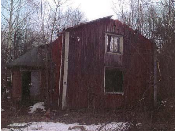
Sutarsin päärakennus on 1830-luvulta, katto ja välipohja ovat romahtaneet. Saanut purkuluvan.
