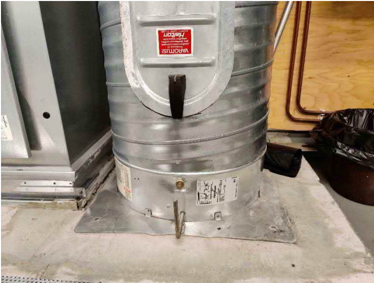
Kuva 184. Konehuoneen palopellit ovat jousikuormitteisia. Palopelleissa ei ole rakennusautomaatiojärjestelmään kytettyjä asentotunnistimia.
