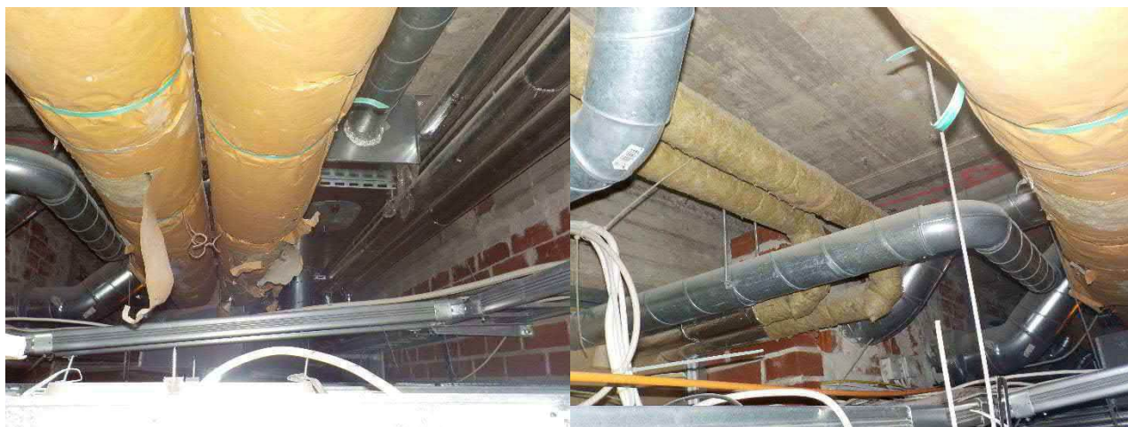
Kuva 165. Päärakennuksen kellaritilojen alaslasketun katon yläpuolella paljaita villapintoja.
