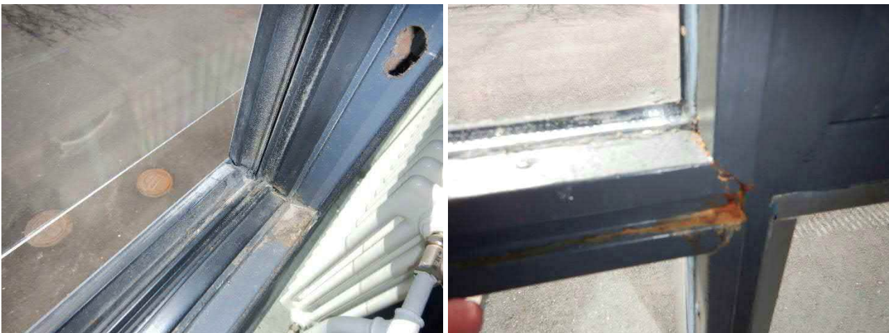
Kuva 133. Eteläpäädyn 2. kerroksen lasiseinässä ruostetta ja tuuletusikkunassa vesivuodon jälkiä.
