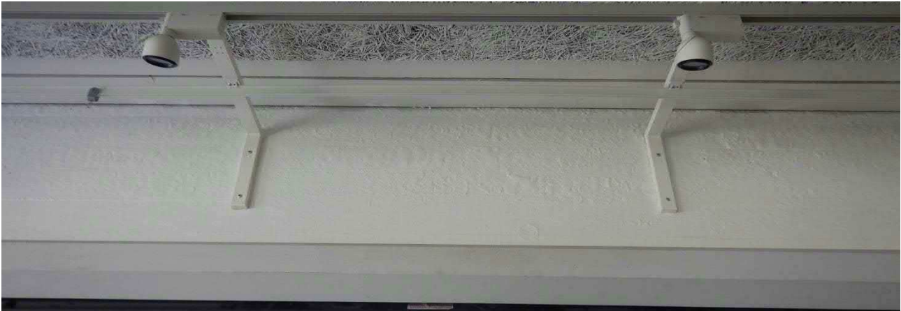
Kuva 119. Ruokailutilassa havaittiin maalin kupruilua katoksen vastaisen ulkoseinän sisäpinnassa.
