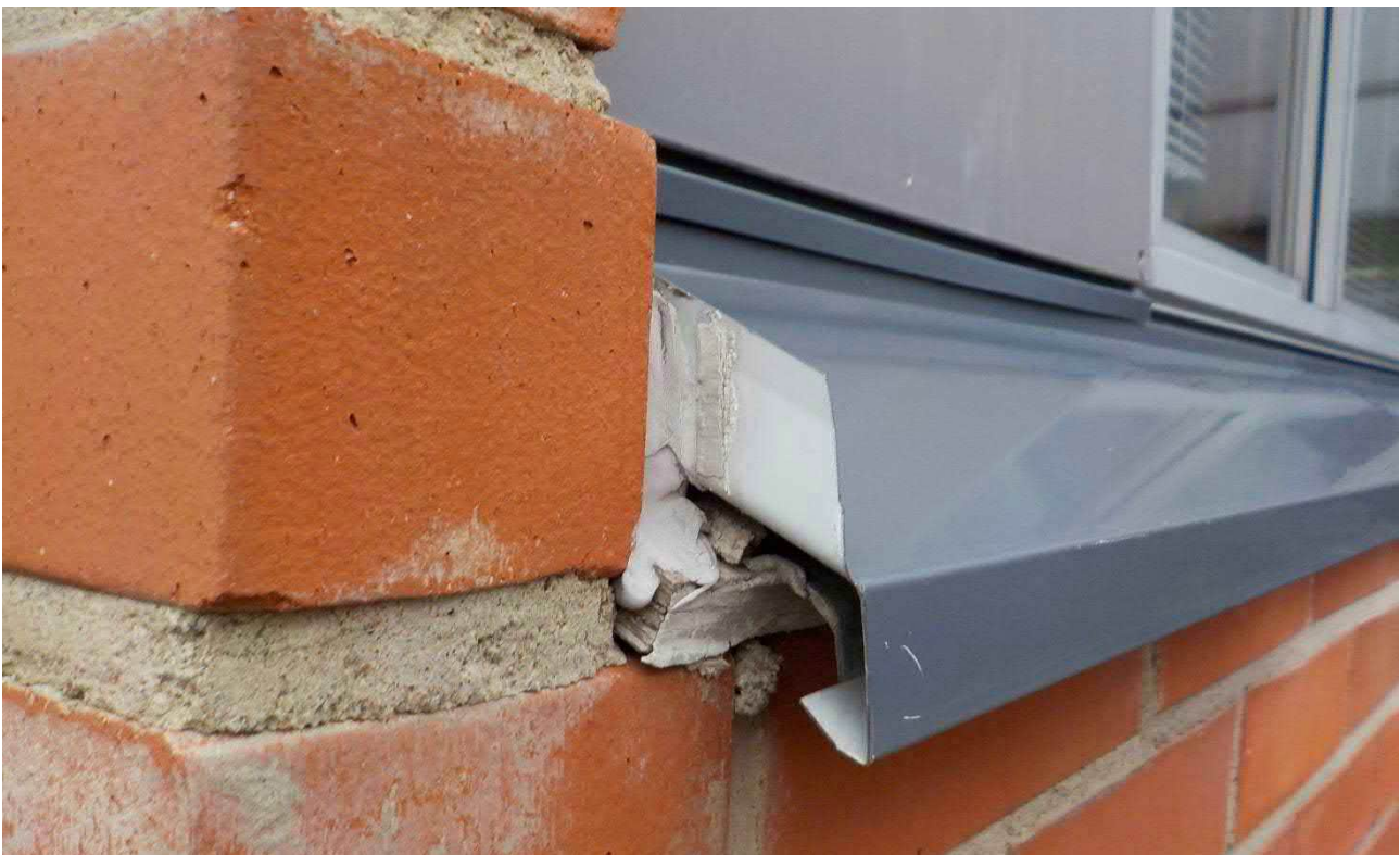
Kuva 135. Laajennusosan eteläseinustalla vesipellityksen liittymä ei ole tiivis tiiliseinään.
