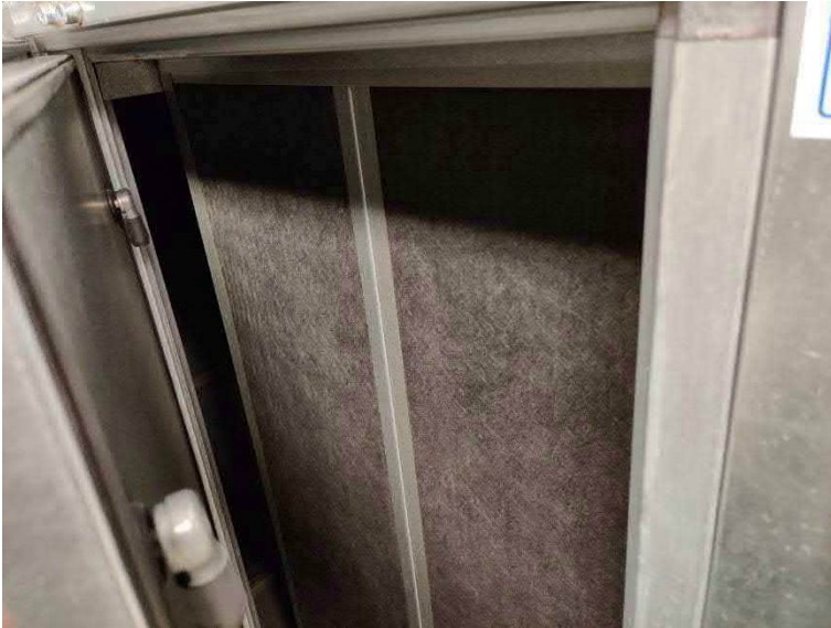
Kuva 180. TK5 äänenvaimentimet todettiin tarkastuksessa polyesterikankaalla pinnoitetuiksi ja kankaan pinnat ehjiksi.
