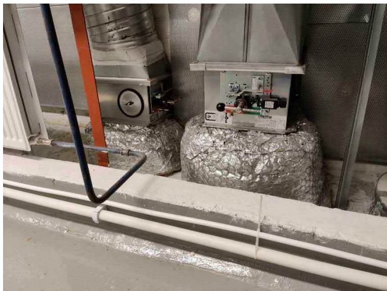
Kuva 179. Konehuoneen palopellit varustettu mikrokytkimillä, mutta kytkinten asentotiedon RAU-järjestelmään välittävä johdotus puuttuu.
