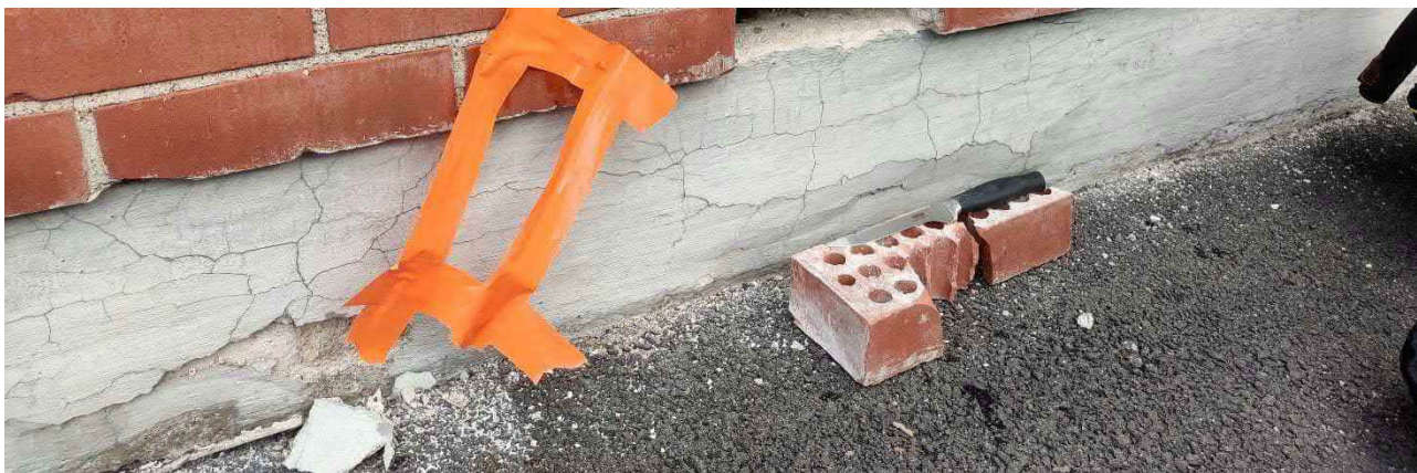
Kuva 34. Päärakennuksen eteläpäädyn sokkelin ulkopinnan tasoitteessa runsaasti halkeilua ja irtoilua.
