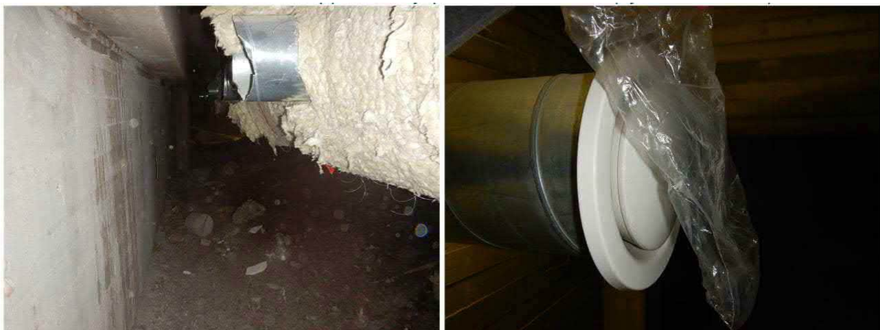
Kuva 176 Kellarin kaivamattoman tilan ilmanvaihtokanavisto. Kanavistossa ei havaittu ilmavirtaa.
