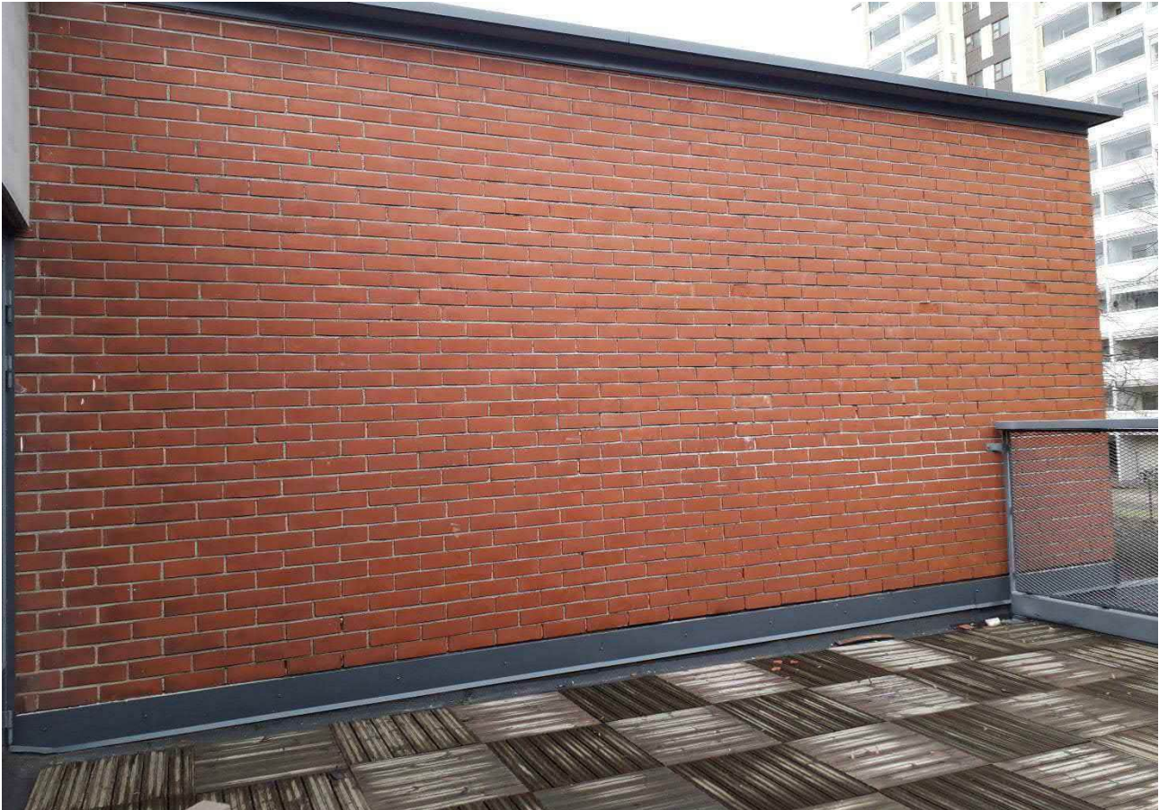
Kuva 140 Ruokalan ulkoseinä kastunut terassin/sisääntulokatoksen liitoskohdalta.
