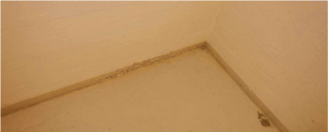
Kuva 166. Päärakennuksen [REDACTED] maalin irtoilua maanvastaisten seinien alaosissa.
