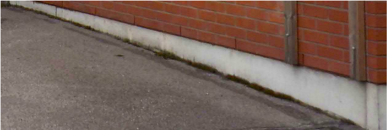
Kuva 35. Päärakennuksen ja laajennusosan sokkelien ja asfaltin rajalla sammalkasvua.
