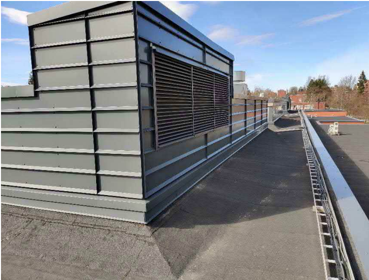
Kuva 174 TK2:n ja TK3:n yhteinen tuloilmasäleikkö
