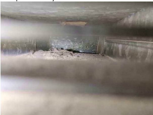
Kuva 191 Auditorion alimman penkkirivin alapuolella sijaitseva likaantunut kanava, jossa ei tutkimusten aikana havaittu ilmavirtausta. Kanava on todennäköisesti poistettu käytöstä.
