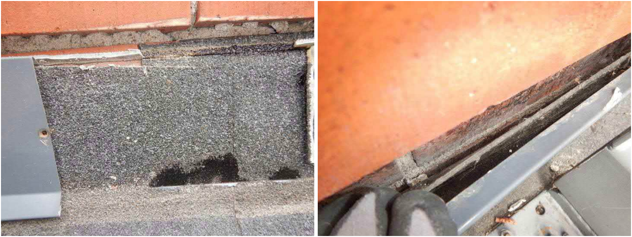
Kuva 141. Kattoterassin pellityksessä ja vesikatteessa havaittiin puutteita.
