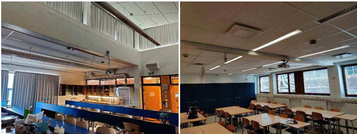
Kuva 192 Luokkatilojen ilmanjako on toteutettu suutinkanavilla tai kattoon asennetuilla tuloilmahajoittajilla, eikä ilman jakautumisessa tarkastettujen tilojen osalta havaittu puutteita.
