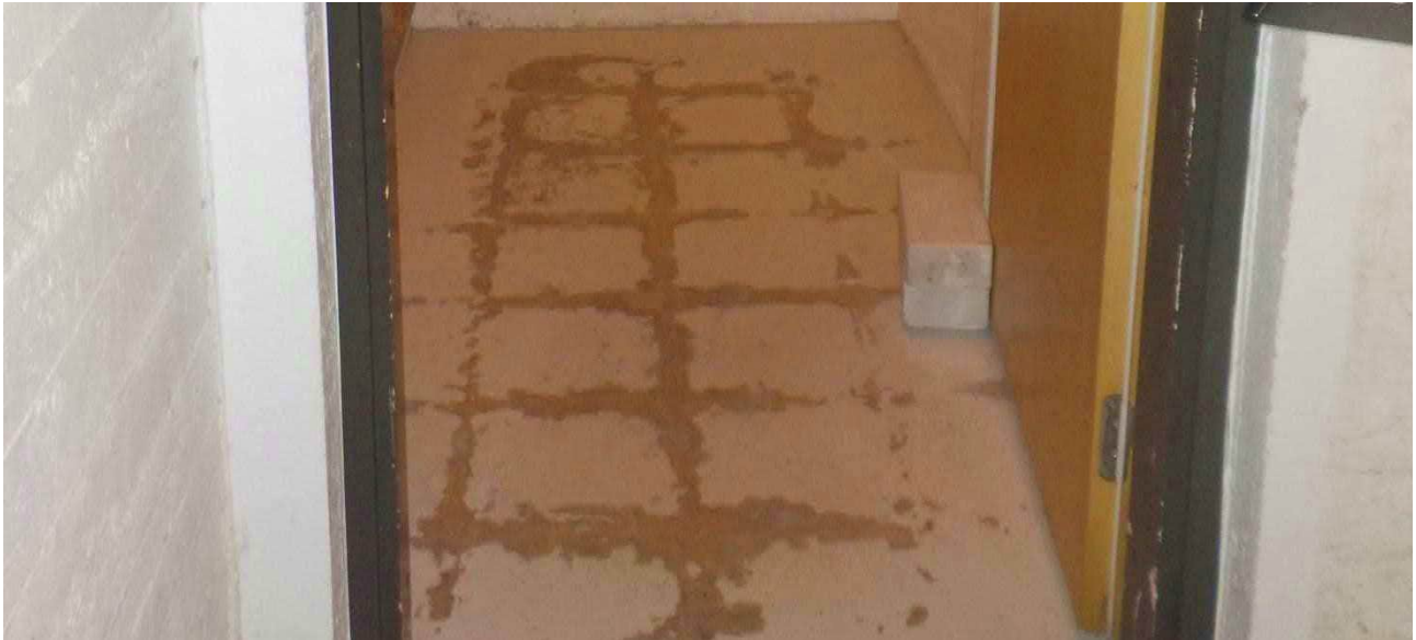
Kuva 100. Keittiön läheisen porraskuilun lattiapinnalla havaittiin systemaattista maalin irtoilua.
