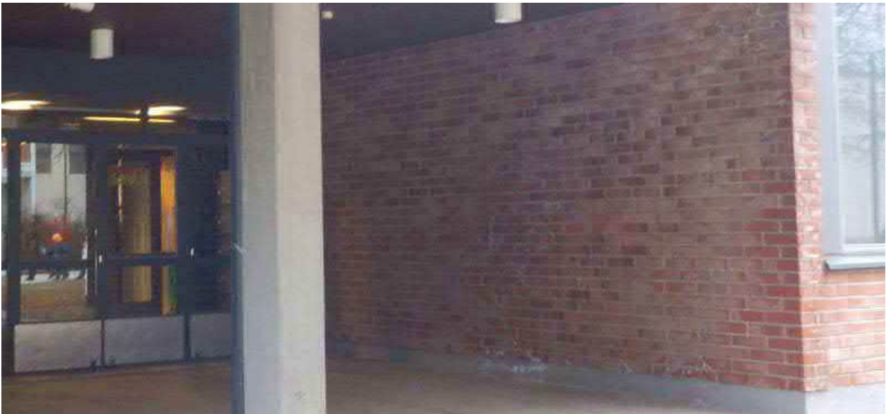
Kuva 1. Myyrmäenraitin puoleisen pääsisäänkäynnin ulkoseinärakenteessa kosteusjälkiä.
