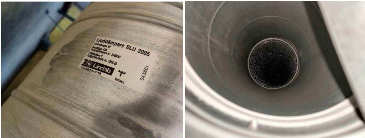
Kuva 188. Luokkatilan 037 tuloilmakanavan äänenvaimentimessa äänenvaimennin materiaalina on mineraalivillaa, joka on pinnoitettu polyesterikankaalla ja reikäpellillä. Kanavien sisäpinnat olivat puhtaat.
