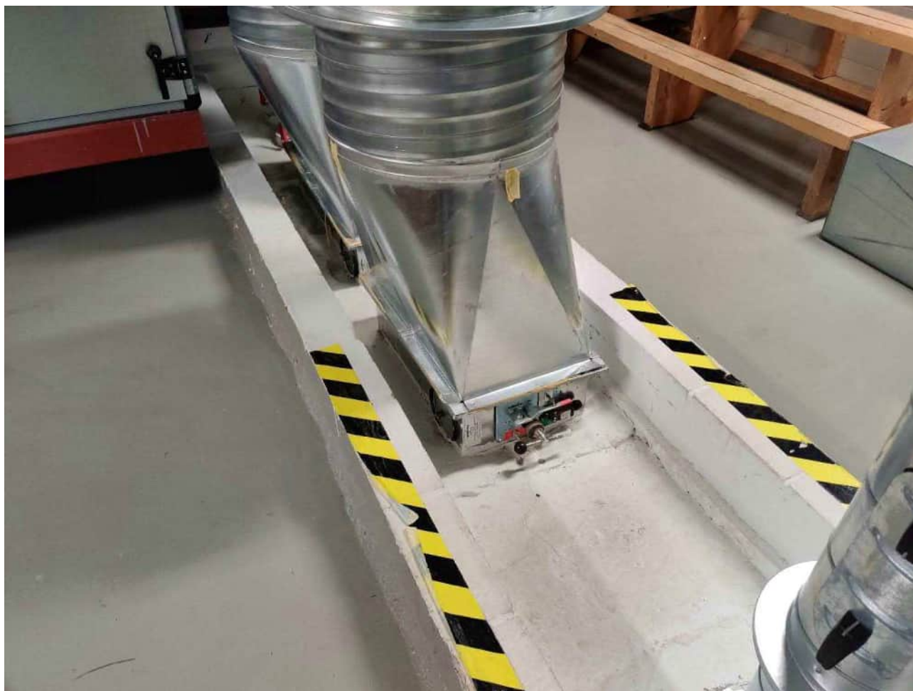
Kuva 177. Konehuoneen palopellit varustettu mikrokytkimillä, mutta kytkinten asentotiedon RAU-järjestelmään välittävä johdotus puuttuu.
