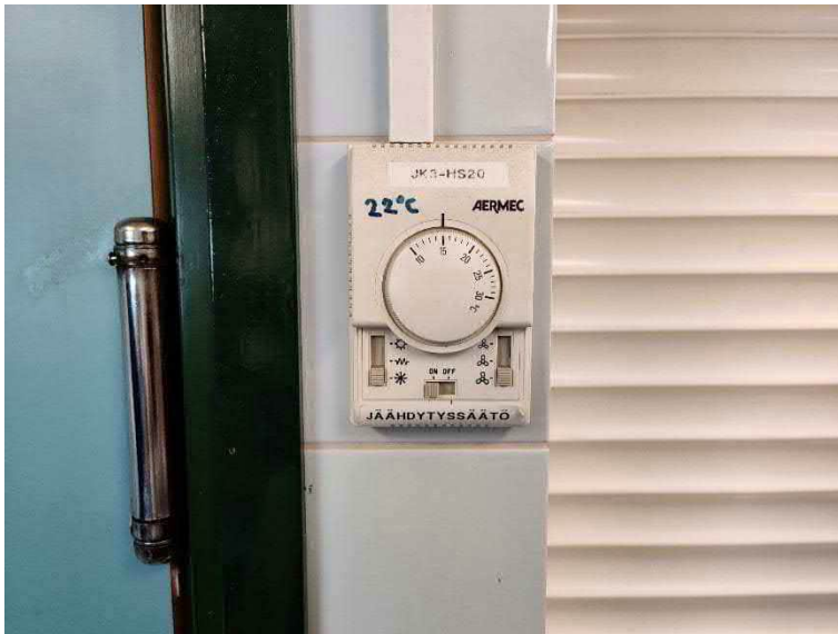
Kuva 198. Keittiön tiskauslinjan jäähdytyskoneen termostaatti JK3-HS20.
