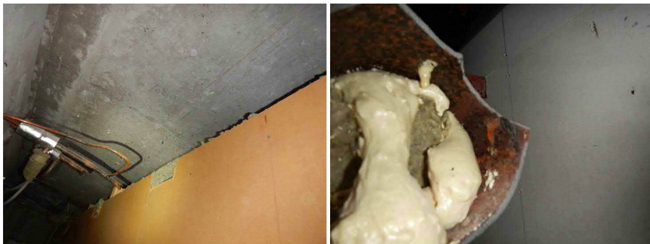
Kuva 65. A-osan tuuletetussa välitilassa paljasta villapintaa ja vanhoja tukittuja viemäriputkia.
