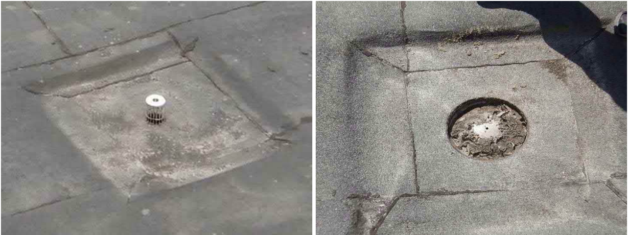
Kuva 11. Vasemmalle kuvassa on asianmukainen roskasihti. Oikealla on sadevesikaivo, joka oli tukkeutunut roskasta päärakennuksen katolla.
