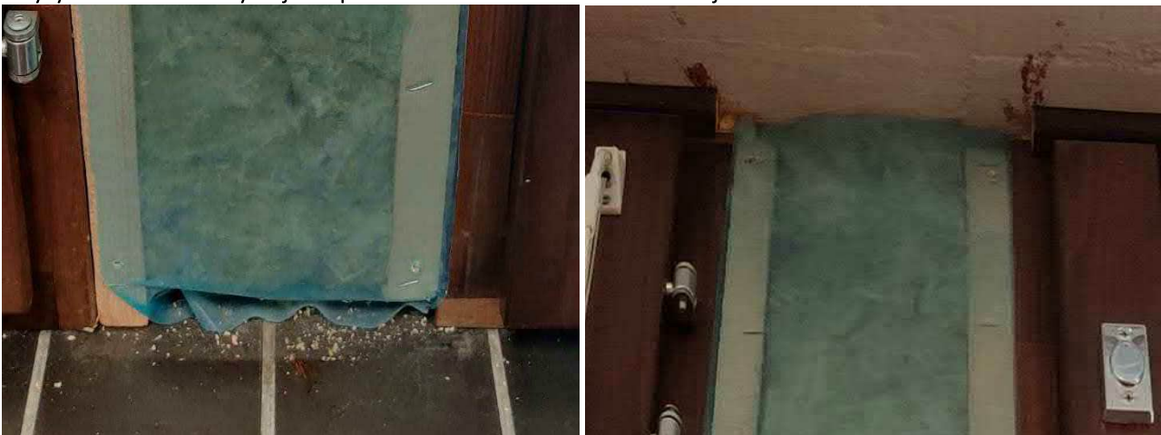
Kuva 137. Höyrynsulkumuovien asennustavassa havaittiin puutteita.
