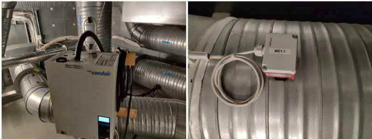
Kuva 181. TK5 tuloilmaa kostutetaan höyrykostuttimen avulla. Tuloilman kosteutta ohjaa TK5-ME1.1.
