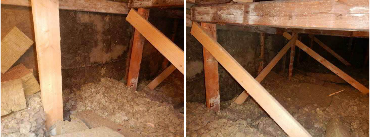
Kuva 154. Yläpohjassa YP5 merkkejä vauriosta kattoikkunoiden alapuolella.
