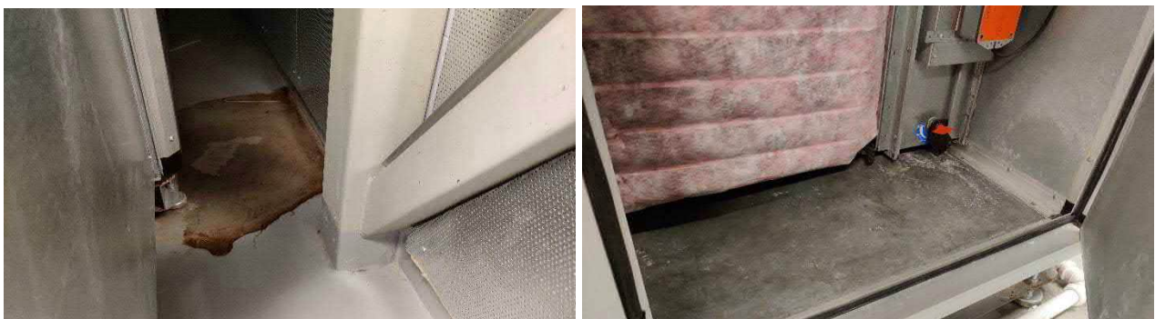
Kuva 183. TK7:n suodatinosan takana havaittiin jälkiä koneen lävitse kulkeutuneesta vedestä. Myös suodatinosan sisäpuolella havaittiin merkkejä sinkkipinnoitetun pellin ajoittaisesta kastumisesta.
