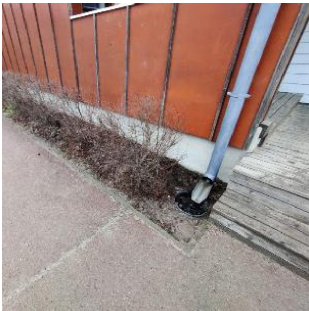
Kuva 21. Sadevedet ohjataan erilliseen järjestelmään, kuva on sisäpihalta.
