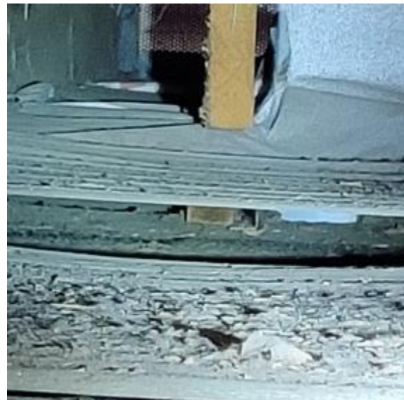
Kuva 78. Aluskate roikkuu kanavaläpiviennin kohdalla. Vesikatteen alapuolinen liitoskohta on epätiivis näköinen. Kuva on otettu lappeen suuntaan.
