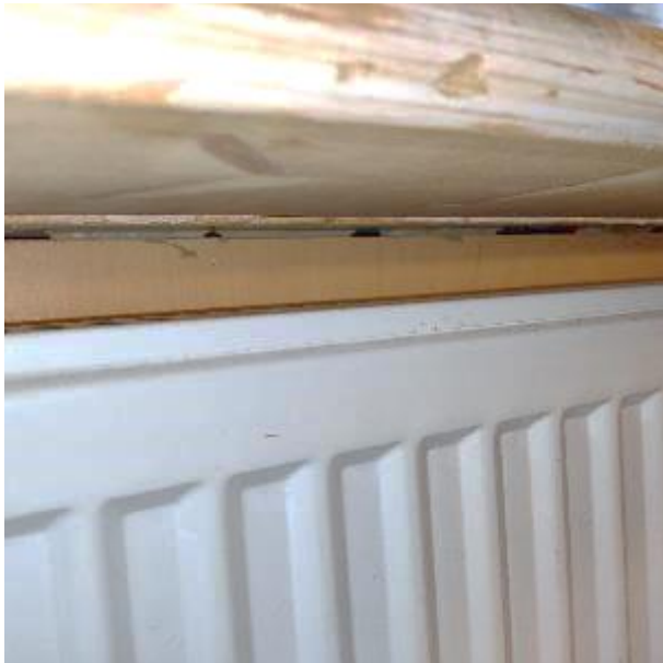
Kuva 70. Ikkunalautojen alla on rakoja ja yhteys seinärakenteen eristetilaan.
