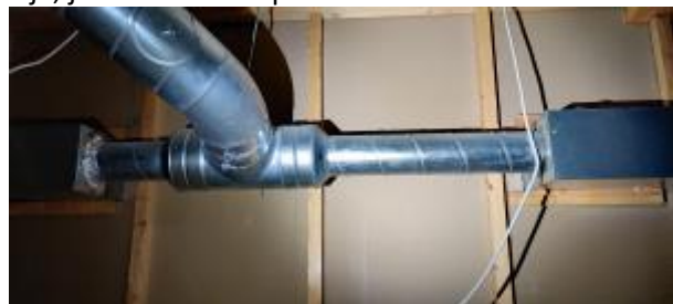
Kuva 123. Tulopäätelaitteiden asennustapa ei kaikilta osin noudattanut tuotteen valmistajan ohjeistusta. Va-ohjeen mukaan on noin 20 cm kattopinnan alapuo- semmanpuoleisen päätelaiteen suojaetäisyys puut- lella. Päätelaitteiden asennuskorkeus suhteessa katti- pintaan ei kaikilta osin noudata valmistajan ohjeis- tusta.
