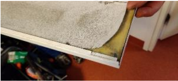
Kuva 119. Siirtoilmalaitteen etusäleän kangaspinta on irronnut, alla avoin villapinta.
