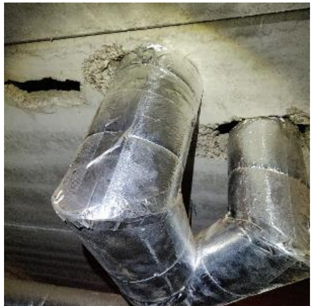
Kuva 42. AP1 ryömintätilan kautta on lukuisia epätiivelyskohtia, joiden kautta todettiin merkkiaineen kulkeutumisen sisätiloihin.
