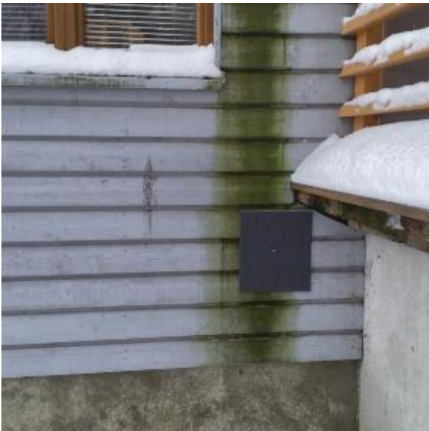
Kuva 66. Sadevesikourun kautta tullut kosteus on kastellut ja värjänyt ulkoseinää tilan 104 kohdalla. Kohdassa merkitty rakenneavaus US1.1.
