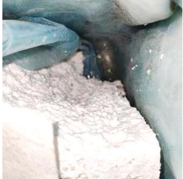
Kuva 40. AP1 avaus kuvattuna ylhäältäpäin. Höyrinsulun limitys on puutteellinen.
