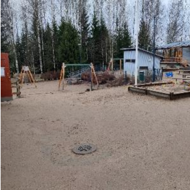
Kuva 23. Sadevedet ohjataan erilliseen järjestelmään, kuva on sisäpihalta.
