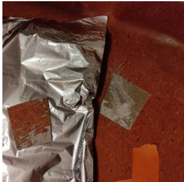
Kuva 46. AP2 pinnassa olevasta muovimatosta otettiin VOC- materiaalinäyte. Laatan pinnassa on kohonneita kosteuslukemia. Kuva on tilasta 011.
