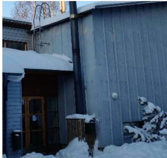
Kuva 67. Laudoituksen alaosa on halkeillut sateen vaikutuksesta tilan 131 kohdalla. Korkea seinärakenne on altis viistosateelle myös lyhyehkön räystään takia.
