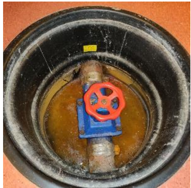
Kuva 18. Padotuskaivon pohjalla on vettä. Putkijoina on ruostunut. Veden pinta on jäljistä päätellen ollut jossakin vaiheessa korkeammalla.
