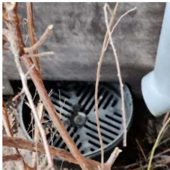
Kuva 84. Tilan 142 kohdalla kattovedet eivät ohjautu sadevesijärjestelmään lyhyen syöksyputken takia.
