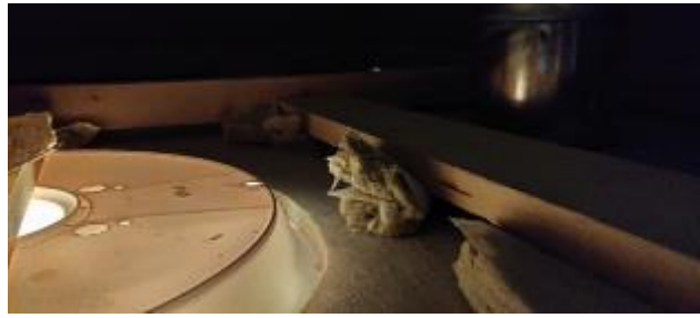
Kuva 128. Alakaton yläpuolella alakattojen asennuksesta muodostuneita villapaloja.
