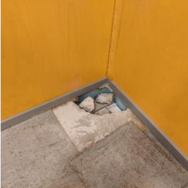
Kuva 39. AP1 avaus tilassa 104. Nurkan kautta virtasi kylmää ilmaa. Seinälevyn alareunassa on villatilke.
