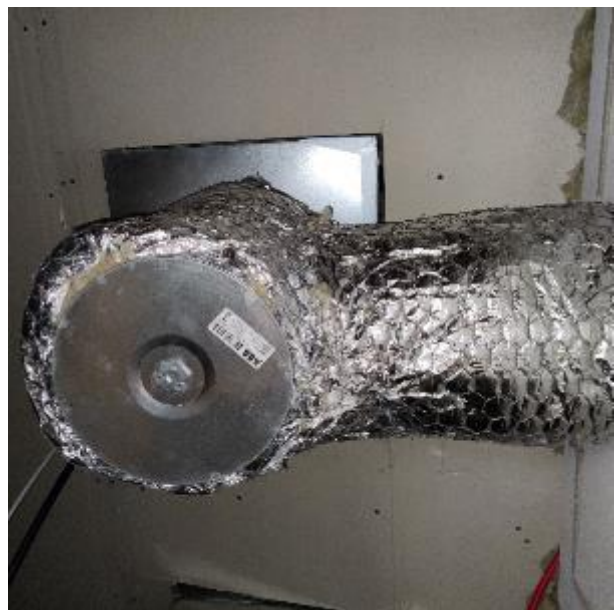
Kuva 89. AK1 avauskohdalla havaitut kosteusjäljet ovat seurausta kanavan pintaa pitkin kulkeutuneesta kosteudesta.
