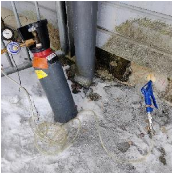
Kuva 33. Merkkiainekaasun syöttöä sokkeliin tilan 125 kohdalla. Rakenteen tiiveys vuotaa sisäänpäin.
