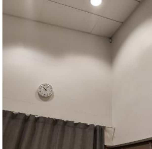
Kuva 51. IV-konehuoneen tiiliseinässä on lievää halkeilua (tila130).
