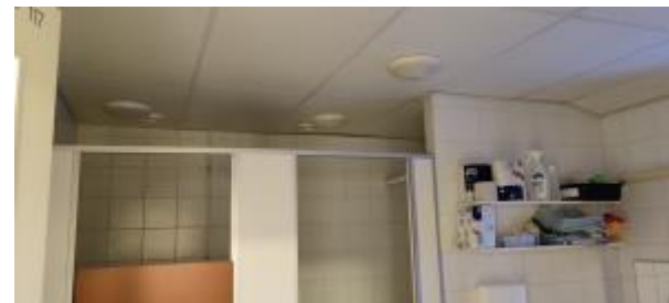
Kuva 126. WC-tiloissa ilman siirtymisellä poistolaittei- siin ei ole estettä.
