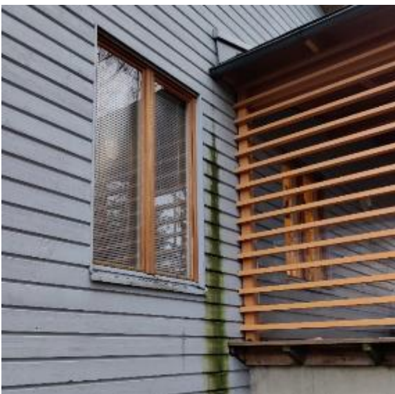
Kuva 83. Tilan 104 kohdalla sadevesikourun päätylaippa vuotaa.
