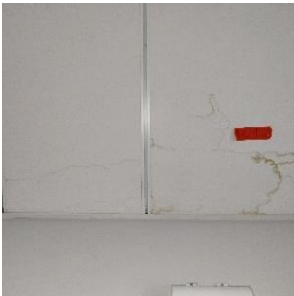
Kuva 88. Vesivuotojälkiä tilan 102 kohdalla (AK1).
