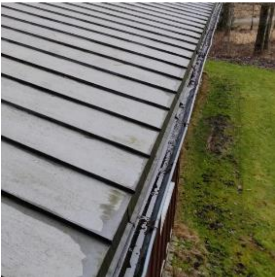
Kuva 81. Pohjoisen puolella vesi padottaa kourussa puutteellisen kaadon takia.
