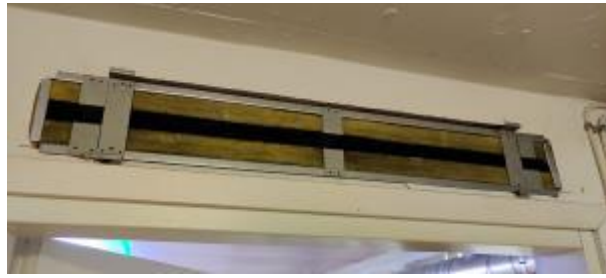
Kuva 120. Siirtoilmalaitteen seinän lävistävässä rakenteessa avoimia villapintoja.
