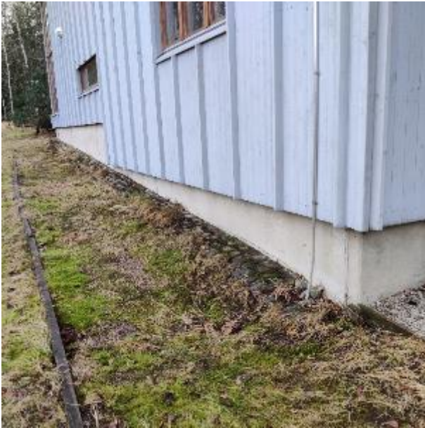
Kuva 31. Sokkelin näkyvä korkeus vaihtelee maanpinnan ja rakennuksen perustamiskorkeuden mukaan. Kuorisokkeleiden saumauksissa on rakoja. Kuva on pohjoissivustalta.
