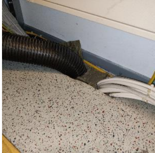
Kuva 44. Sähköryhmäkeskusten läpiviennit ryömintätilan suuntaan on tiivistämättä (kuva tilan 135 kohdalta).
