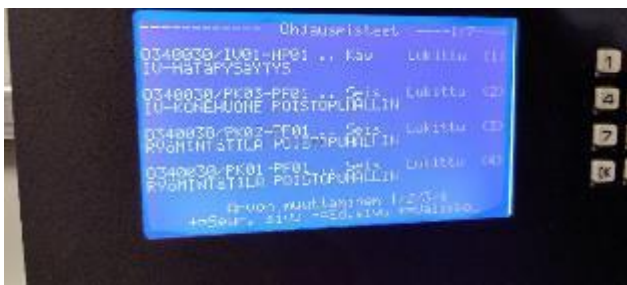
Kuva 117. Ryömintätilan puhaltimet ovat seis -asennossa.
