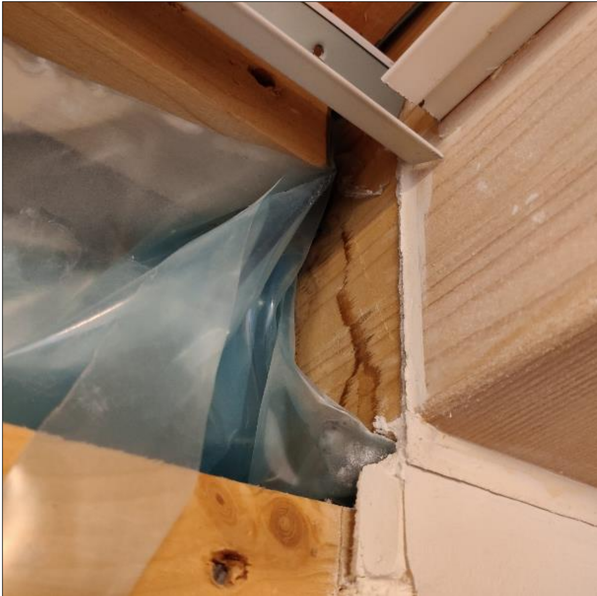
Kuva 54. Höyrinsulku on epätiivis ja levyn kittaus on rakoillut. Palkin reunassa näkyy vesivuotojälkiä (tila 104).
