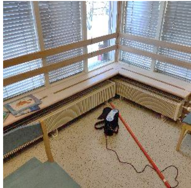
Kuva 71. Metallirakenteisten ikkunoiden liitoksissa on runsaasti ilmavuotoreittejä (tila 131).
