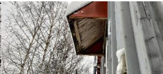
Kuva 102. Puisen katoksen alapinnoilla mikrobikasvuun viittaavia jälkiä.
