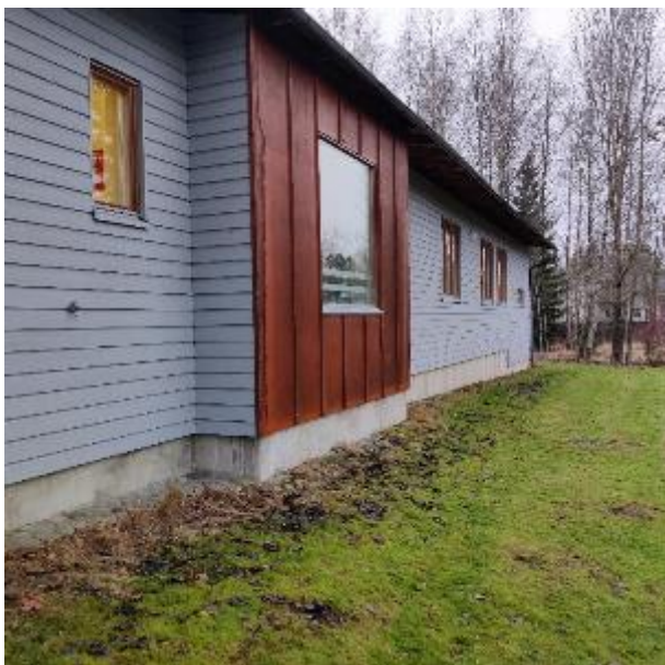
Kuva 7. Kuvassa on pohjoispuolen vierustaa. Kallistukset ovat pois päin rakennuksesta.
