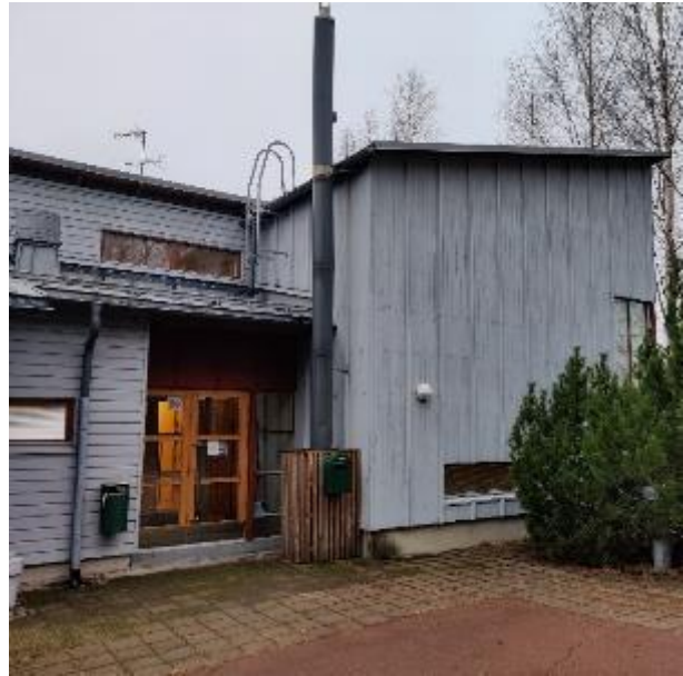
Kuva 32. Itäisellä sivustalla sokkelin näkyvä korkeus on matalin. Rakenne on osittain ns. valesokkeli. Kuorisokkelissa on tummentuneita kohtia.
