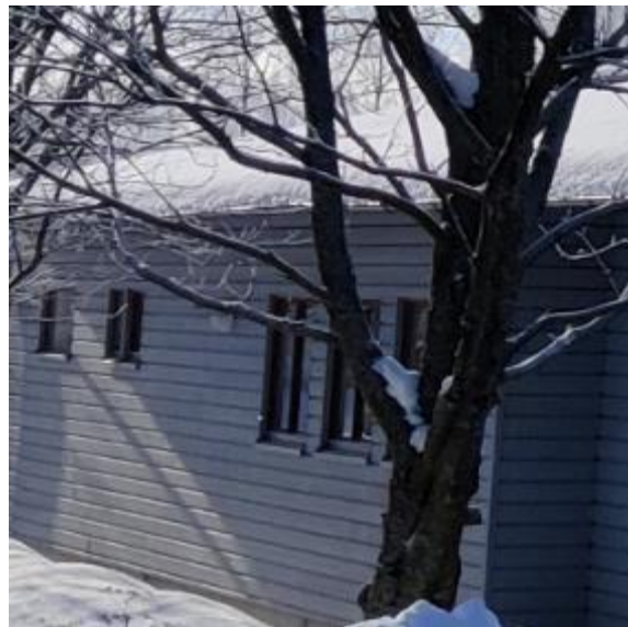
Kuva 82. Keittiön 152 kohdalla sadevesikouruissa havaittiin voimakasta jääpadotusta.
