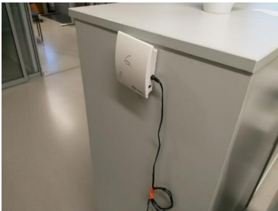
Esimerkkikuva. Sisäilman hiilidioksidipitoisuusmittaus (FCG Oy).
