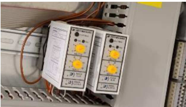
Kuva 109. TK1 ja TK2 jäätyssuojat, hälytysraja n. +8 °C. Jälkilämmityspatterin jäätyssuojatermostaatti (ylempi) ja puhaltimen seisoma-aikana patterin paluuveden lämpötilan säätö (alempi).
