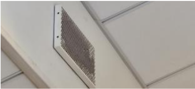
Kuva 127. Tilassa 131 sijaitsevien poistoilmalaitteiden pinnat ovat merkittävästi pölyntyneet.
