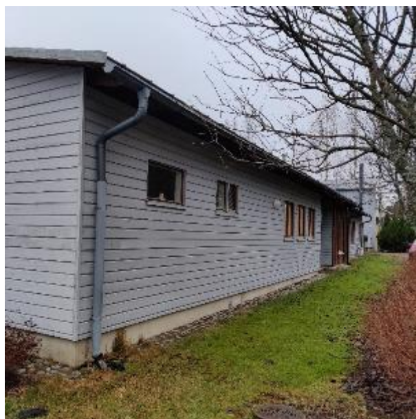
Kuva 10. Reunustan kiveys on sammaloitunut (keit-tiön ja varastojen kohta).
