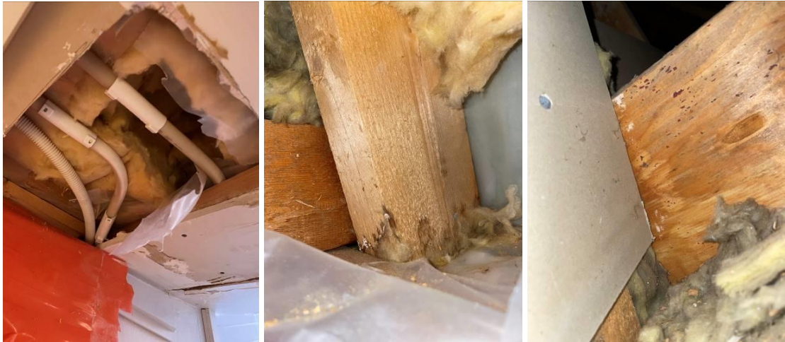
Kuva 32. Kuraeteisen 01 rakenneavauksen RA18 mineraalivillaeristeestä ja pystypuusta otetuissa materiaalinäytteessä (MR15-16) todettiin mikrobikasvustoa. Pystypuussa havaittiin kosteusjälkiä ja lämmöneristeissä tummentumaa ilmavuodoista. Kosteuden lähdettä ei saatu tutkimusten aikana selville.
