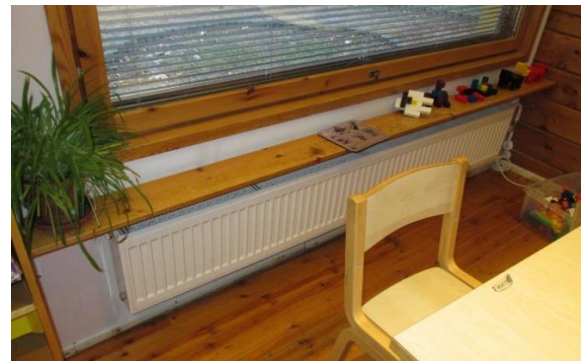
Kuva 6. Uudemmalta vaikuttava radiaattori pienryhmähuoneessa 06.
