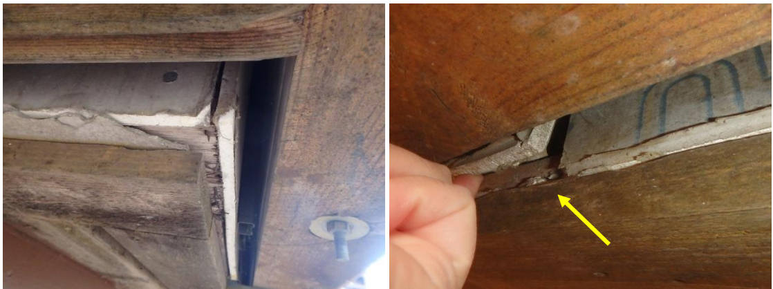
Kuva 23. Ulkoseinärakenteen tuulensuojalevyissä oli paikoin rakoja ja länsipäädyssä ne olivat heikosti kiinni seinässä. Länsipäädyn sisäänkäynnin rakenneliittymistä oli päässyt vettä tilan 07 ulkoseinä- ja alapohjarakenteisiin, ja oven vasemmalla puolen ulkoseinän alaohjauspuussa todettiin kohonnutta kosteutta.
