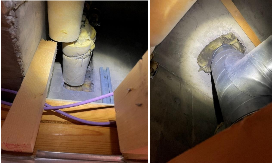
Kuva 28. Väliseinän VS8 ja välipohjan läpivienneissä havaittiin pinnoittamatonta mineraalivillaa. Kuvat ovat yhteistilan 17 alueelta.
