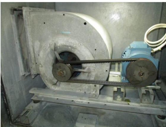
Kuva 28. PK 1 poistoilmakammion pohjalla on pölykertymää.
