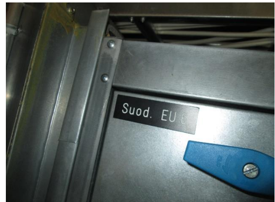
Kuva 21. TK1 on alun perin mitoitettu EU 6 / F6 tuloilmasuodattimille. Nykyiset suodattimet vastaavat F7...F8 luokkaa.
