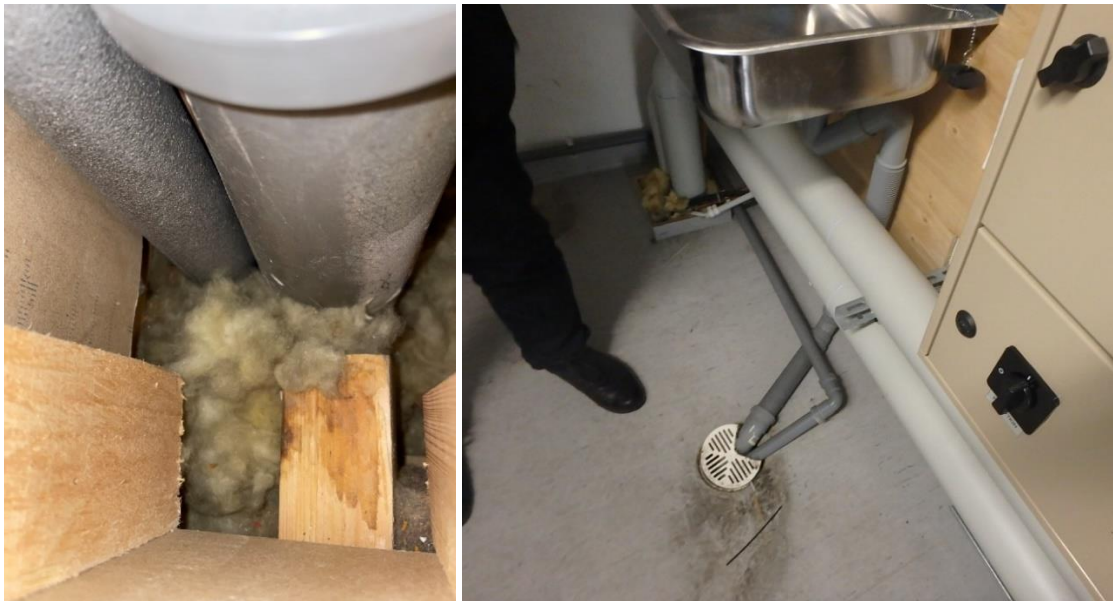
Kuva 29. Vasemmalla kuvassa verstaan 16 sadevesiviemärin koteloinnin puukoolauksen kosteusjälki. Oikealla kuvassa IV-konehuoneen muovimatto, jonka pinta on paikoin kulunut.
