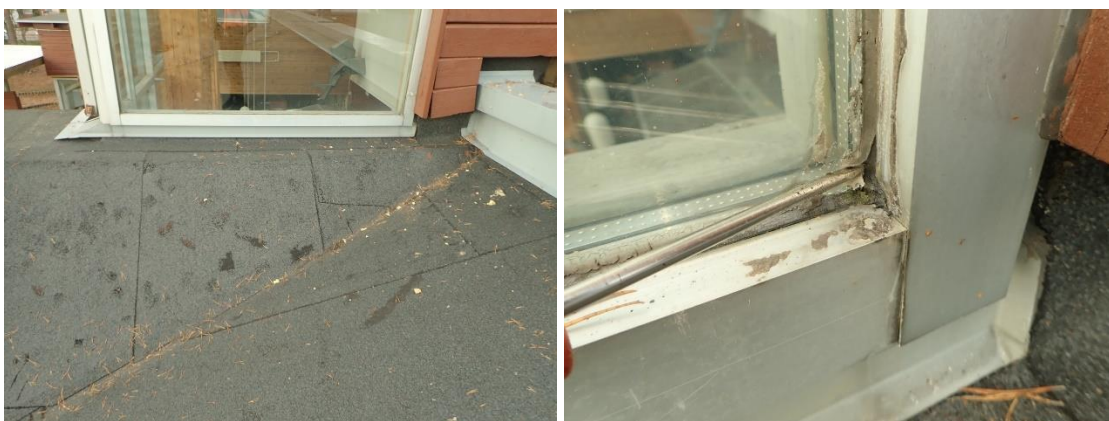
Kuva 43. Kattoikkunan edustalla pintakermistä on lähtenyt paloja. Ikkunan kittaukset ovat rikki.
