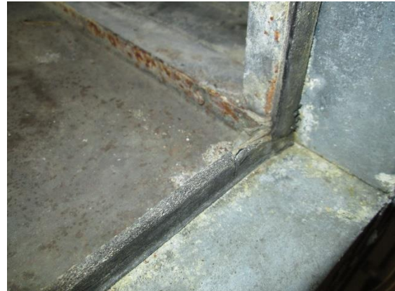
Kuva 19. TK1 suodatinkammion pohjalla on kor-roosiota.
