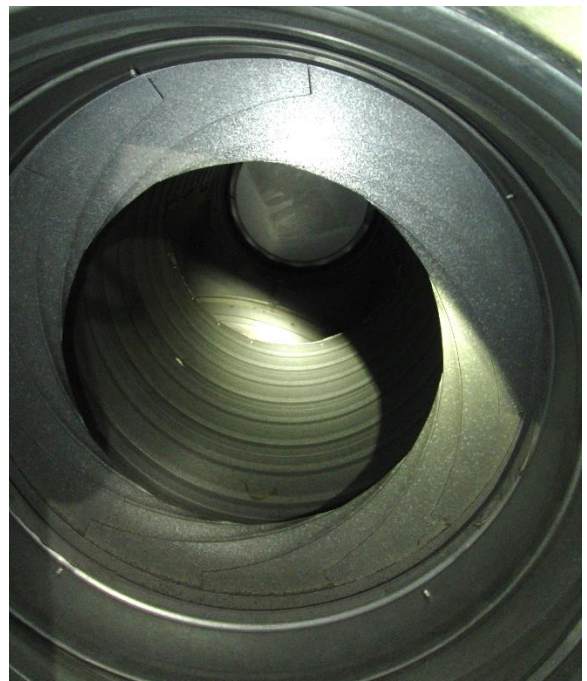
Kuva 37. Iris -säätöpelti keittiön tuloilmakanavassa sekä nousukanavan pohja.
