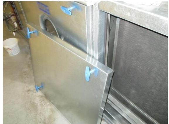
Kuva 25. TK1 tuloilmapuhaltimen painepuolella on lamelliäänenvaimennin, joka vaiuttaa jälkikäteen lisätystä. ÄV lamellit lasikuitukankaalla päällystettyä mineraalivillaa. Puhaltimen paineaukon ja lamellien etureunan välissä tilaa noin 50 mm, joten ÄV kuristaa puhaltimen ilmavirtaa.
