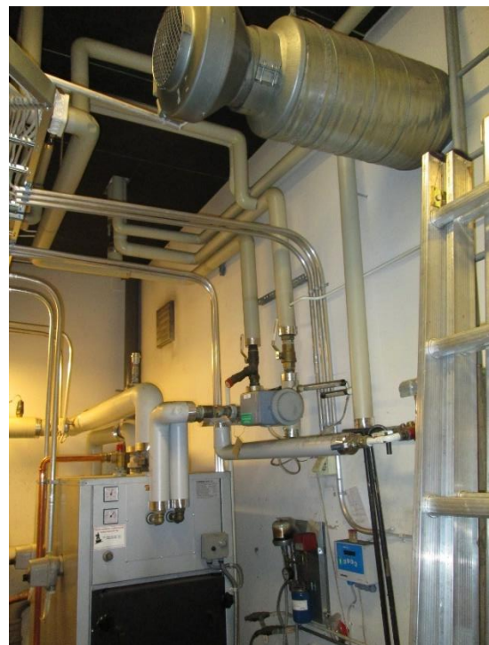
Kuva 33. Kattilahuoneen poistopuhallin on termostaattiohjattu kanavapuhallin.
