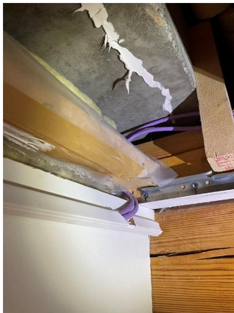
Kuva 15. Ulkoseinä alakaton yläpuolella keittiön 18 edustalla. Ulkoseinän eristetila on avonainen alakattotilaan.
