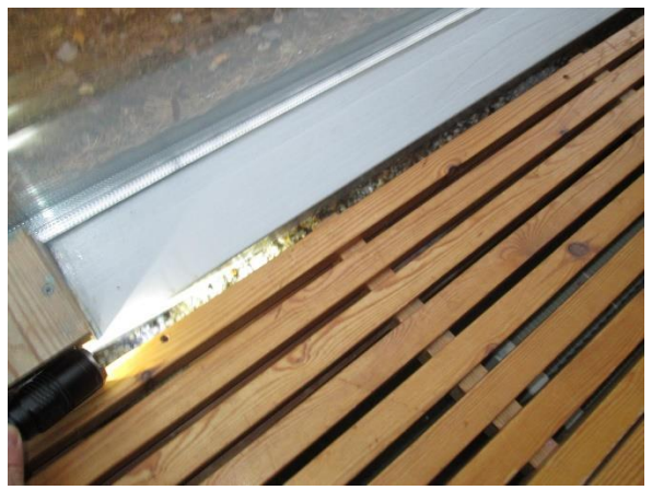
Kuva 10. Yhteistilan 17 konvektorit on sijoitettu lattiasyvennykseen, joka päällä on puusäleikkö. Säleikön virtausaukot ovat pieniä, mikä heikentää lämmitystehoa.
