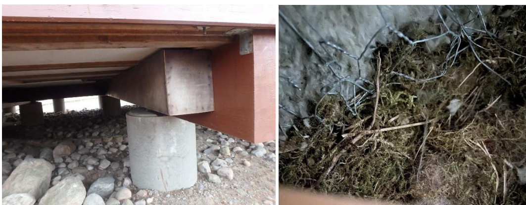
Kuva 11. Ryömintätilallisen alapohjan alapuolella on koteloinnit lämmöneristetyille viemäriputkille. Koteloinnin sisässä oli eläimen pesä.
