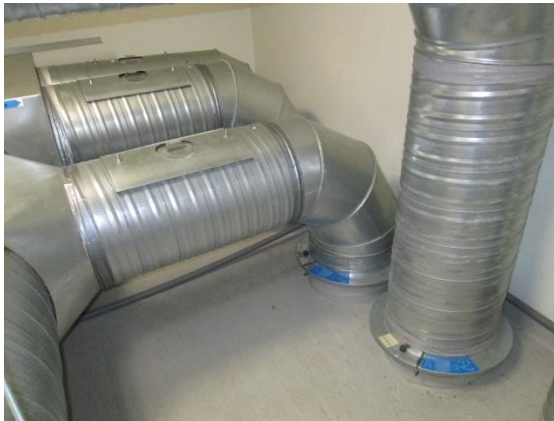
Kuva 34. IV-konehuoneessa näkyvillä olevat kanavat on varustettu kertasäätöpellein ja puhdistusluukuin.
