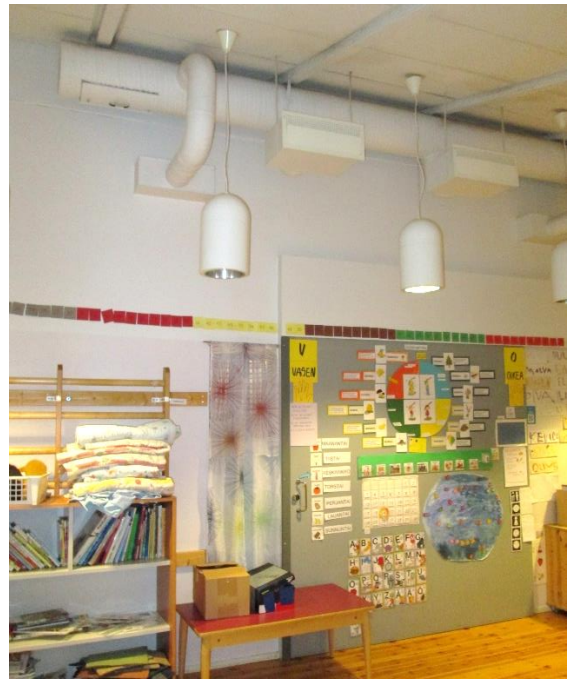
Kuva 41. 07 leikki/lepohuoneen tuloilmalaitteet ja tilan 08 päätelaatikot.
