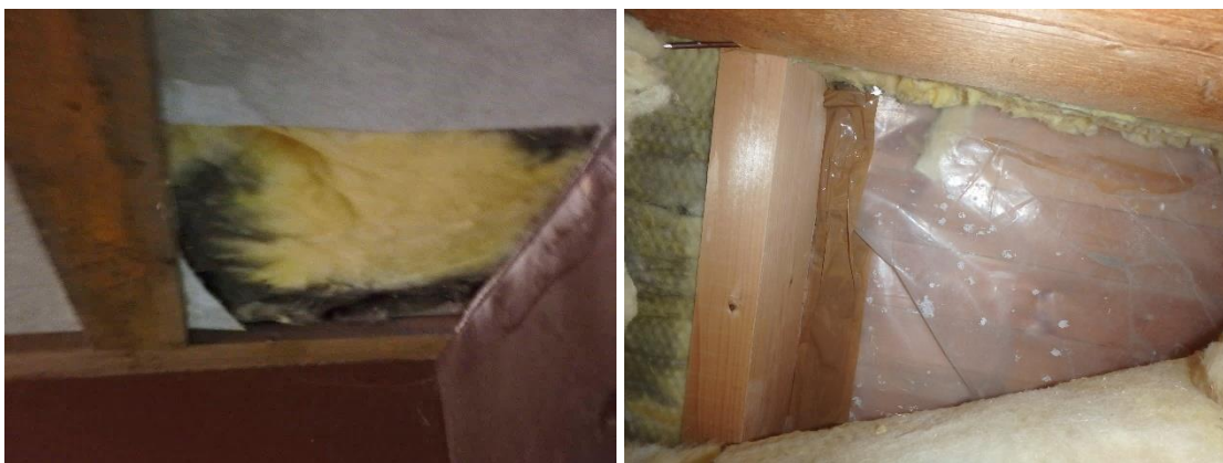
Kuva 10. Ryhmätilan 10 kohdalle tehdyssä rakenneavauksessa RA20 alapohjan lämmöneristeissä havaittiin tummentumaa ilmavuodoista ja höyrynsulkumuovi oli teipattu kiinni pakkausteipillä. Rakenneavauskohdan vieressä on tekniikkakotelo viemäriputkille, ja lähellä läpiviennit tilojen 07 ja 08 sekä siivouskomeron 05 viemäreille ja sadevesiviemäriille. Lattiat olivat näiltä osin viileät, mikä viittaa ilmavuotoihin rakenteista.
