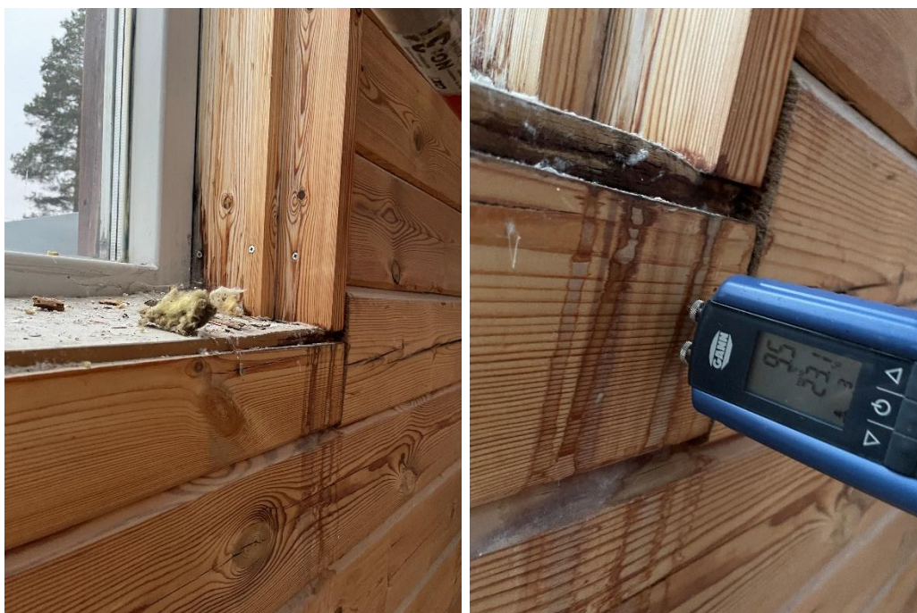
Kuva 16. Korkean osan kattoikkunoista tulleet vesivuodosta näkyi molemmilla seinustoilla vanhoja vuotojälkiä ikkunalaudalla ja hirsiverhoilun pinnassa. Hirressä ei puunkosteusmittarilla havaittu kohonnutta kosteutta 9,5 p-%.
