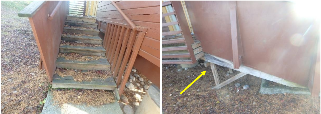
Kuva 22. Länsijulkisivulla on sisäänkäyntiterassi ja portaat, joita ei ole huoltokäsitelty. Portaiden reisipuussa oli jälkiä kosteusrasituksesta. Terassilta todennäköisesti ohjautuu vettä rakenneliittymistä ulkoseinärakenteisiin.
