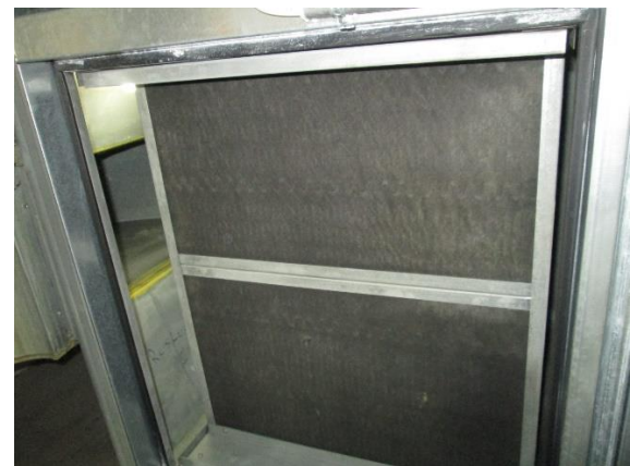
Kuva 29. PK 1 poistopuhaltimen äänenvaimennin. Myös tämä ÄV saattaa kuristaa puhaltimen ilmavirtaa.
