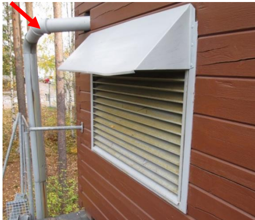
Kuva 13. Ulkoilmasäleikön päälle on lisätty pieni lippa. Kuvassa näkyy myös sadevesiviemäri.
