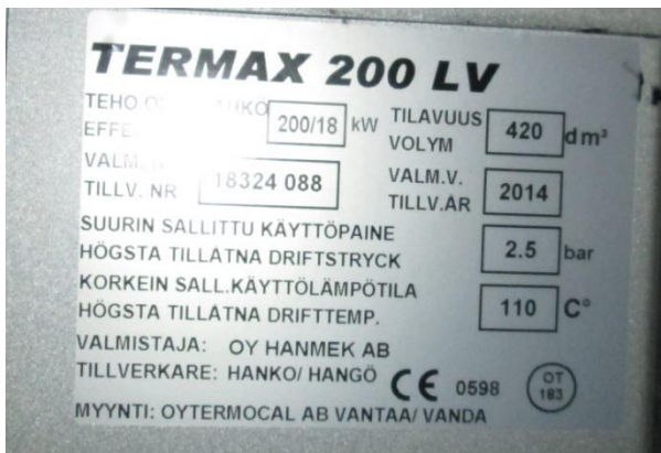
Kuva 3. Öljylämmityskattila on uusittu 2014.
