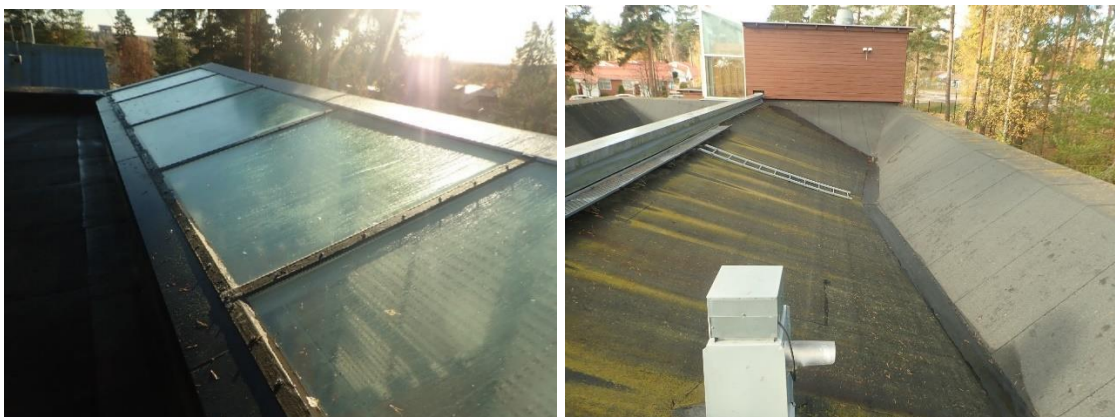
Kuva 41. Korkean osan kattoikkunan saumoja on aiemmin tiivistetty vesivuotohavaintojen jälkeen. Matalan osan kermiosuudella on paikoin sammalkasvustoa.
