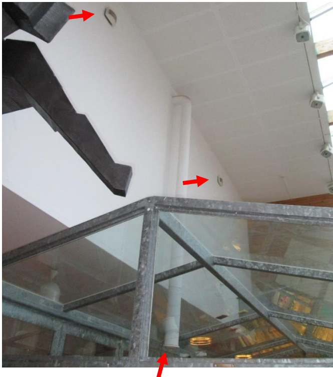
Kuva 48. Käytävän 14 tuloilmalaitteet sijaitsevat korkean tilan yläosassa. Kuvan keskellä sijaitseva poistokanava on vesileikkihuoneen poistoilmakanava, joka on liitetty WC-poistoon.
