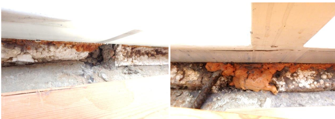
Kuva 6. Yhteistilan 17 ikkunaerkkerin sokkelieristeissä on rakoja, joista voi esiintyä ilma- ja lämpövuotoja. Raudoitukset ovat ruostuneet. Rakoja on osittain paikattu polyuretaanivaahdolla.
