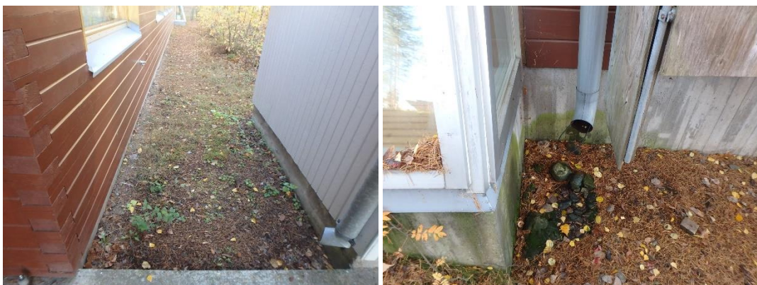
Kuva 19. Rakennuksen katosten sadevedet ohjattiin syöksytorvilla rakennuksen vierelle. Syöksytorvien alla ei ollut sadevesikaivoja vaan vesi imeytyy maaperään. Sadevedet oli pääsääntöisesti ohjattu kattokaivoista rakennuksen sisällä kulkevin sadevesiviemärein rakennuksen alle ja sieltä pihalla olevaan sadevesikaivoon.
