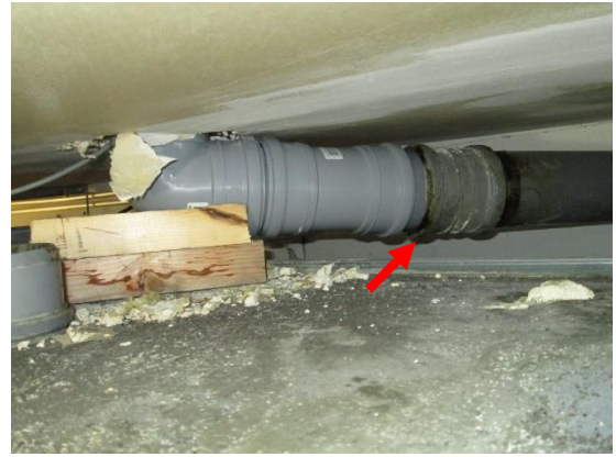
Kuva 52. Sadevesiviemäri iv-konehuoneen katossa on kannakoitu puupalikoilla iv-koneen päältä. Viemärin muhviilitokset vuotavat.
