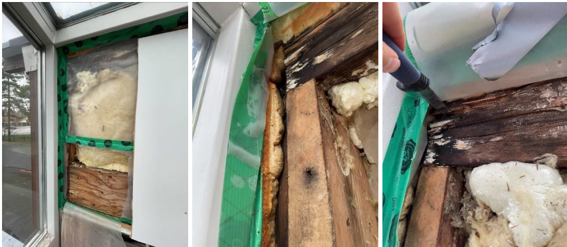
Kuva 33. Käytävän 14 yläpohjatilan vastaisessa seinässä havaittiin merkittäviä kosteusvaurioita. Rakenteen yläohjauspuusta (RA19) otetussa materiaalinäytteessä (MR17) todettiin mikrobikasvustoa. Vauriot ovat aiheutuneet vuotavista kattoikkunan liittymistä.
