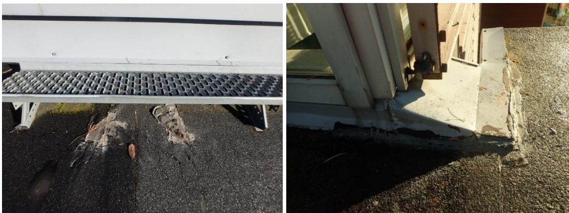
Kuva 39. Kermin halkeilua on paikoin paikkailtu. Matalan osan Ikkunapellitysten tiivistykset rakoilevat.
