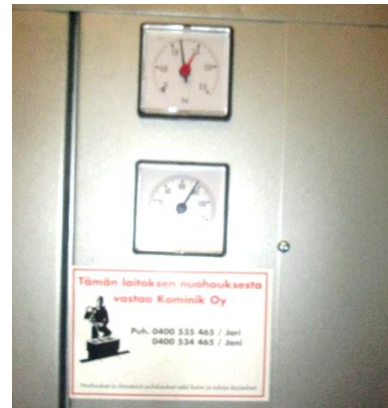
Kuva 4. Kattilaveden lämpötila tarkastushetkellä 76 °C ja verkoston paine 1,2 bar.
