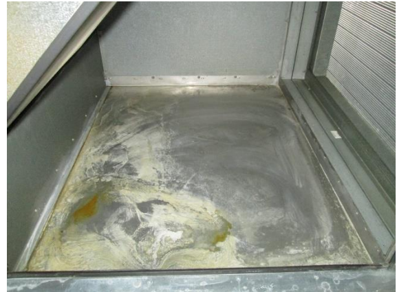
Kuva 23. Kuivunutta likaa ja korroosiojälkiä LTO-osassa.
