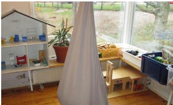
Kuva 5. Termostaattiventtiilillä varustettu vanha konvektori. Lähes konvektorin yläpinnassa kiinni oleva penkki heikentää lämmitystehoa.
