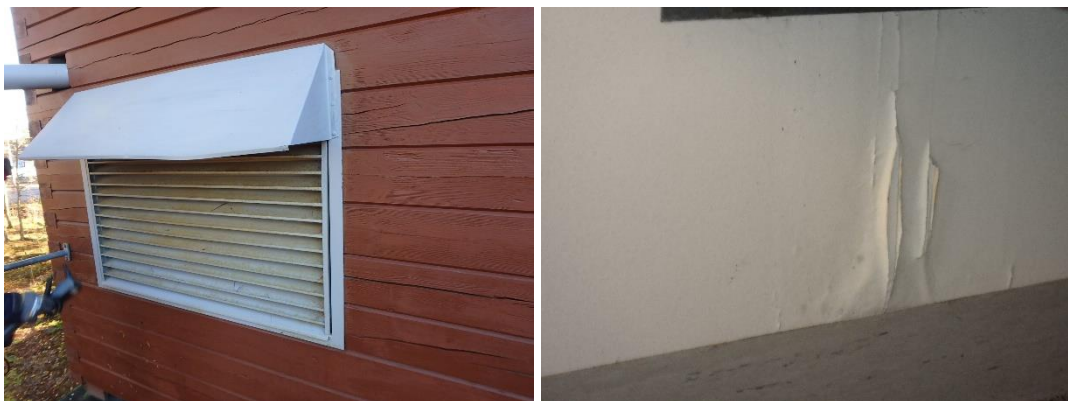
Kuva 25. Toisen kerroksen ilmanvaihtokonehuoneen ulkoseinän sisäpinnassa havaittiin kupru ulkoilmanottoaukon nurkan kohdalla. Ulkoseinärakenteeseen on todennäköisesti päässyt kosteutta tuloilmanottosäleikön rakenteista.
