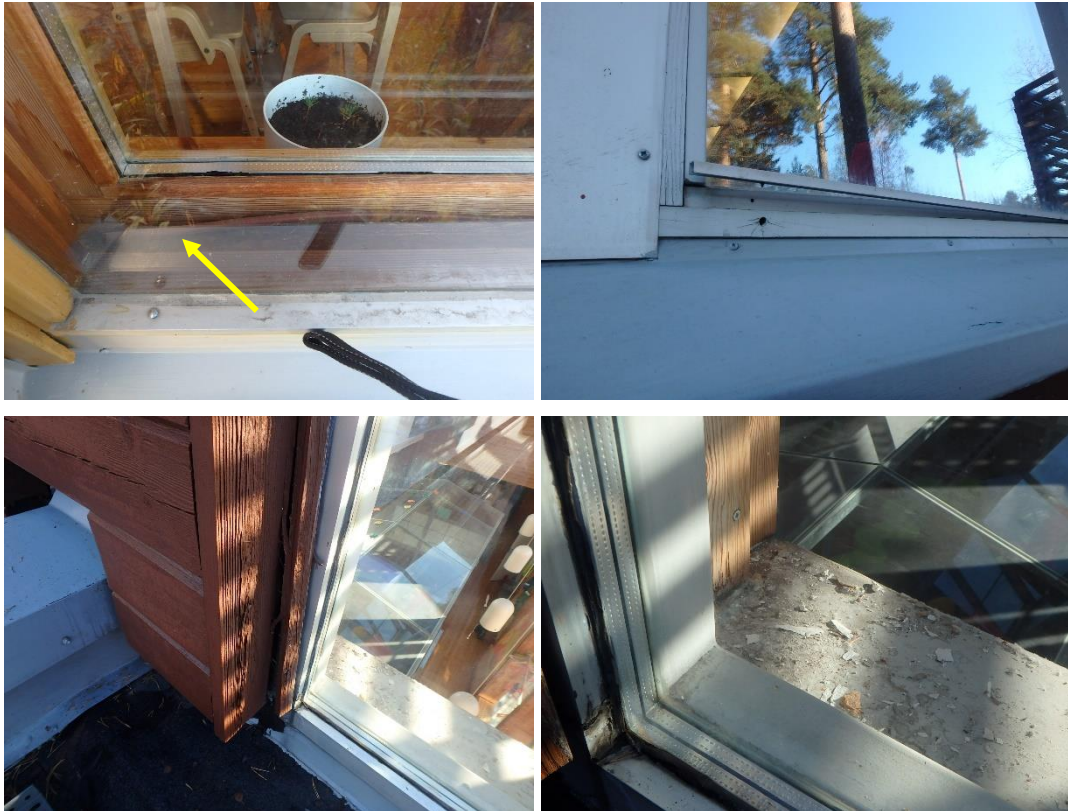
Kuva 24. Pienryhmätilan O6 ikkuna oli vuotanut alareunasta ja ikkunatiiviste oli huonosti asennettu. Ikkunakittaukset oli paikoin lohkeilleet ja muutamia ikkunalistoja oli irronnut. Korkealla osalla kattoikkunoiden vuotoja oli korjattu, mutta rakenteissa havaittiin vanhoja vesivuotojälkiä eikä ikkunautoja ollut siivottu.
