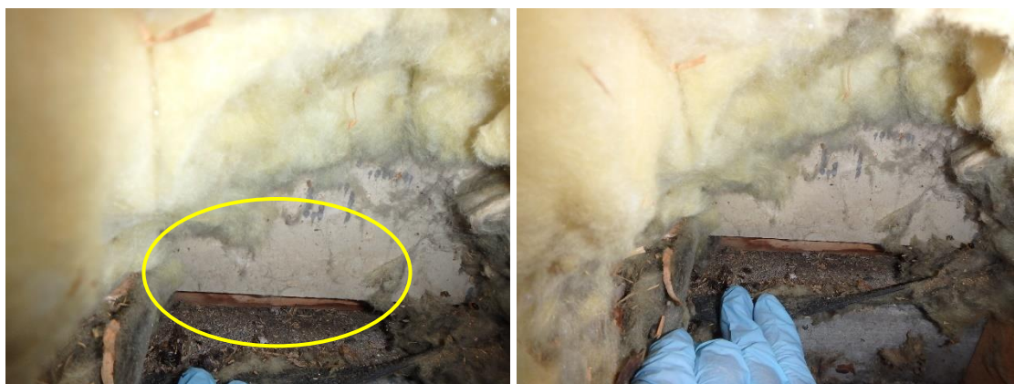
Kuva 13. Ulkoseinärakenteen rakenneavauksessa RA2 otetussa materiaalinäytteessä MR2 todettiin viite vaurioon. Ulkoseinän betonisokkelin päällä oli bitumikermi ja sen päällä olevan alaohjauspuun alaosassa sekä tuulensuojalevyn alaosassa havaittiin kosteusjälkiä. Alaohjauspuussa ei kuitenkaan havaittu kosteutta 12,1 p-%. Tuulensuojalevy ei ulotu sokkeliin asti. Rakenneavauksen kohdalla havaittiin jyrsijän pesä ja ulosteita.
