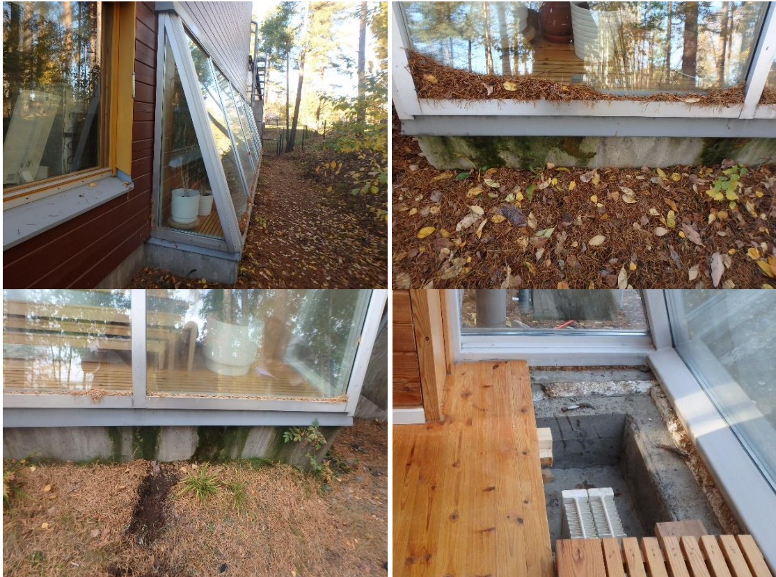
Kuva 20. Rakennuksen keskiosan yhteistilassa 17 on ikkunaerkkeri, jonka solupolystyreenieriste oli yhteydessä sisäilmaan. Sokkelin ulkopinnalla kasvoi sammalta ja lasin pinnalla ja rakennuksen seinustalle on maatuvaa ainesta. Osa lämpölaseista oli sameita, kun lasien sisälle on todennäköisesti päässyt kosteutta.
