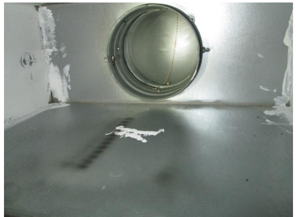
Kuva 43. Ilmavirran mittaus- ja säätöosat saa irrotettua kytkentäkanavan puhdistamiseksi.
