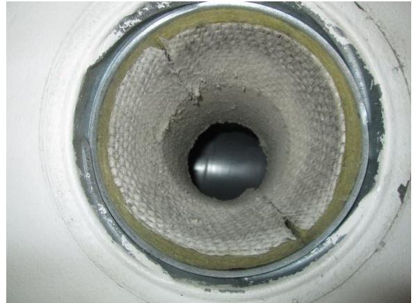
Kuva 45. Tilan 08 poistoilmaventtiilin kytkentäkanavissa on äänenvaimennuspatruunat, joiden vuoksi ilmavirtaa ei saa mitattua ns. mittauskourulla.
