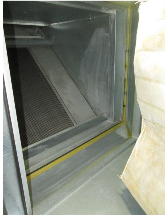
Kuva 27. PK 1 alkuperäiset poistoilmasuodattimet EU 3 / G3, asennetut suodattimet ePM10 75 %. Poistoilmasuodattimet ja suodatinkammio olivat vain lievästi likaantuneet.
