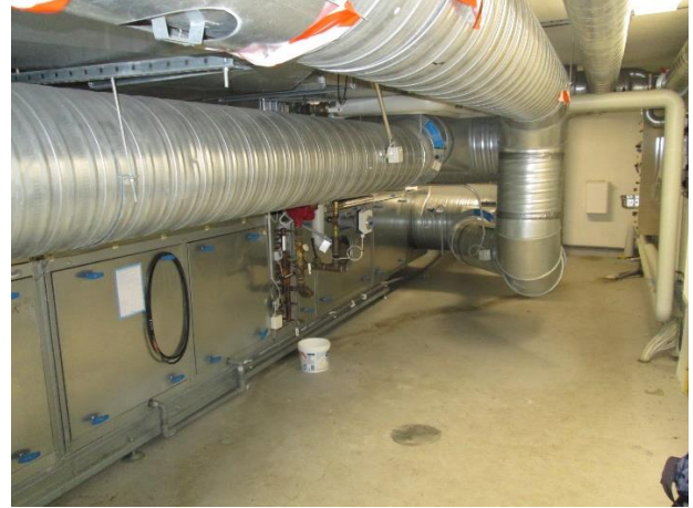
Kuva 12. Ilmanvaihtokonehuone. Konehuoneen lattialla ja iv-koneen päällä on vuotovesijälkiä. Konehuoneen sadevesiviemäri vuotaa, ks. kohta 6.2 muut havainnot.
