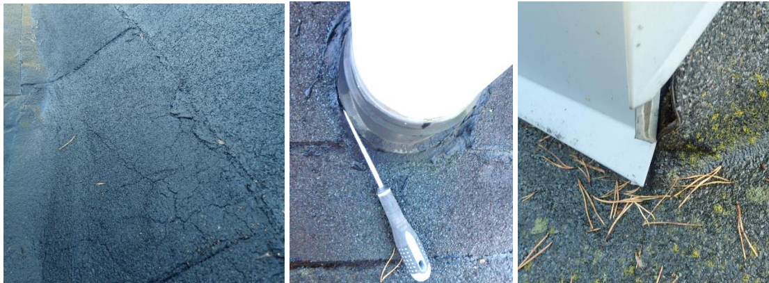
Kuva 38. Kermissä havaittiin paikoin verkkohalkeilua läpivientien kohdilla rakoja.
