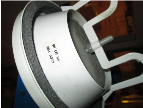
Kuva 44. Tilan 08 poistoilmaventtiili. Lautasen sisällä on äänenvaimennusmateriaalia.
