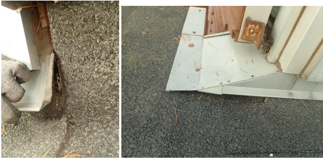
Kuva 44. Korkean osa liittymässä ikkunapellityksen tiiviste on halki. Ikkunoiden puuriläverhouksen kiinnike on ruosteessa.
