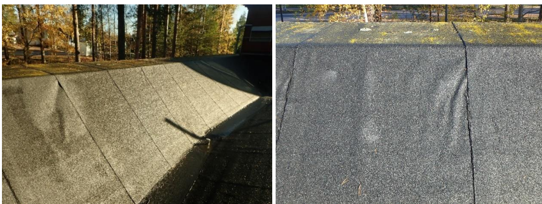
Kuva 37. Vesikaton kermissä havaittiin paikoin ilmataskuja ja rypyttymistä. Kuvat Simonkyläntien puoleiselta osalta.
