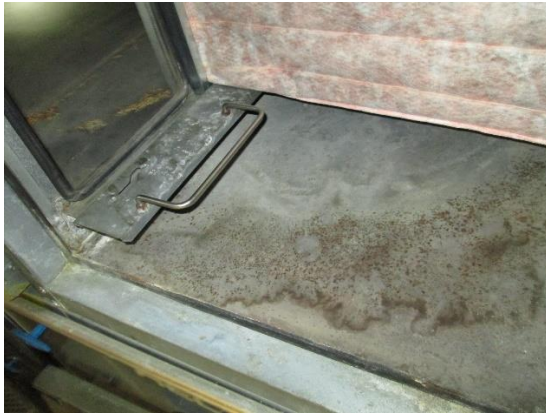
Kuva 18. TK1 ulkoilmasuodattimien kiinnitysmekanismi. Kammion pohjalla on kii-vunutta likaa ja korroosiojälkiä.
