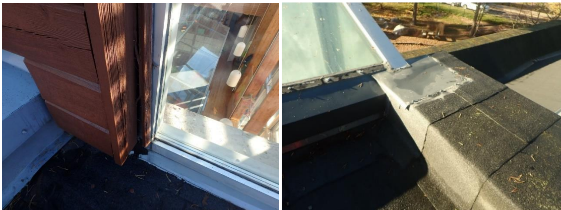
Kuva 40. Matalan osan ikkunaliittymän listoitus on irti. Korkean osan kattoikkunoita on lisätiivistetty.
