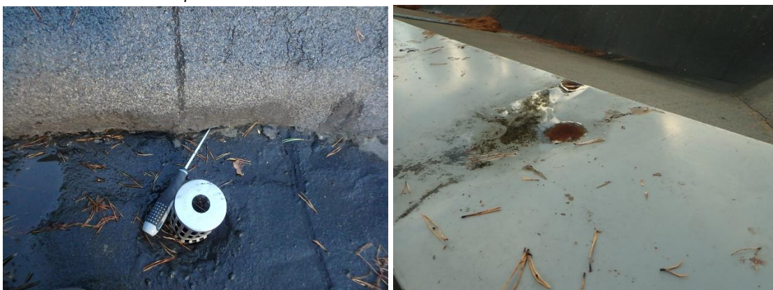
Kuva 42. Kattokaivon kohdalla (tilojen 20–21 alueella) kermin saumassa havaittiin rako. Kermiosuuden keskiharjan pellityksessä PVF 2 -pinnoite on paikoin kulunut puhki ja pellissä on ruostetta.
