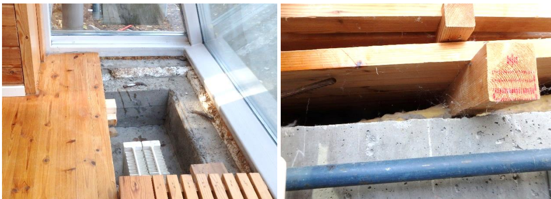
Kuva 5. Yhteistilan 17 ikkunaerkkerissä on puurimoituksella peitetty lattiasyvennykset lämpöpattereille. Betonirakenne oli kuiva. Syvennyksessä ulkoseinäsockkelin lämmöneriste on avoin sisätilaan ja puulattian alapuolinen eristetila on auki syvennykseen, josta voi päästä mineraalivillakuituja ja muita epäpuhtauksia sisäilmaan.
