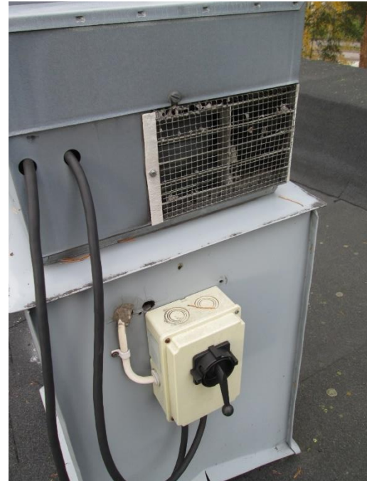
Kuva 31. Länsipäädyn sosiaalitilojen poistopuhaltin PF 1.2. Turvakyttimeen lumilippa puuttuu ja läpiviennit epätiiväitä. Laitteen toisella puolella laitekilvessä mitoitusilmavirta 0,225/0,15 m³/s ts. tässäkin alempi ilmavirta on 2/3-osaa täysitehosta.
