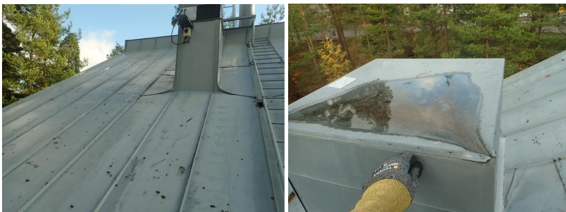
Kuva 47. Peltikatteessa havaittiin pinnoitteen kulumista ja ruostetta. Peltikate on huoltomaalauksen tarpeessa. IV-laitteen vedenohjaus tule korjata.
