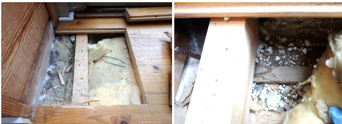
Kuva 4. Käytävän 17 terassille johtavan käyttämättömän oven vieressä havaittiin vesivuotojälkiä ovirakenteesta tai alapuolisesta rakenneliittymästä tulleet kosteudesta ja alapohjarakenteen rakenneavauksen (RA9) lattiarakenteen tukipuusta (MR6) ja sokkelin solupolystyreenieristeestä (MR7) otetuissa materiaalinäytteissä todettiin mikrobikasvustoa. Alapohjan lämmöneristeissä havaittiin tummentumaa ilmavuodoista.
