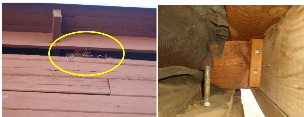
Kuva 17. Räystäiden tuuletusrako oli paikoin leveä ja räystäällä havaittiin lintujen pesiä. Räystäään tuuletusväliin oli asennettu verkko, joka ei ole tiivis yläpohjassa havaituista syödyistä kävyistä ja jätöksistä päätellen.
