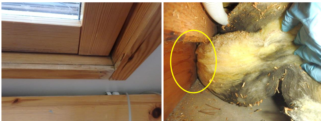
Kuva 3. Alapohjarakenteisiin tehdyissä rakenneavauksissa pienryhmähuoneen 06 ulkoseinällä tekniikkakotelon viereisen rakenneavauksen (RA17) mineraalivillaeristeestä otetussa materiaalinäytteessä (MR14) todettiin mikrobikasvustoa. Ulkoseinän alaohjauspuussa havaittiin kosteusjälkiä todennäköisesti ikkunavuodosta ja lämmöneristeissä tummentumaa ilmavuodoista. Rakenneavauksen yläpuolella oleva ikkunarakente on vuotanut, jolloin myös ulkoseinän rakenteet voivat olla paikallisesti vaurioituneet.
