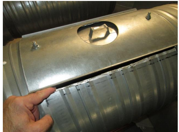
Kuva 35. Keittiön tuloilmakanavan puhdistusluukussa oli rako.
