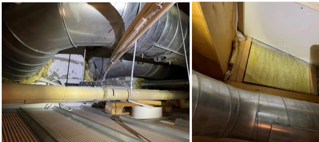
Kuva 27. Väliseinien yläosissa ja läpivienneissä havaittiin pinnoittamattomia mineraalivillapintoja. Kuvat ovat eteisen 38 alueelta.
