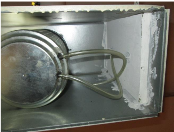
Kuva 42. Tilan 07 tuloilmapäätelaatikon sisäpinta. Laatikon äänenvaimennusmateriaali on pinnoitettu kuitujen irtoamista ehkäisevällä aineella.
