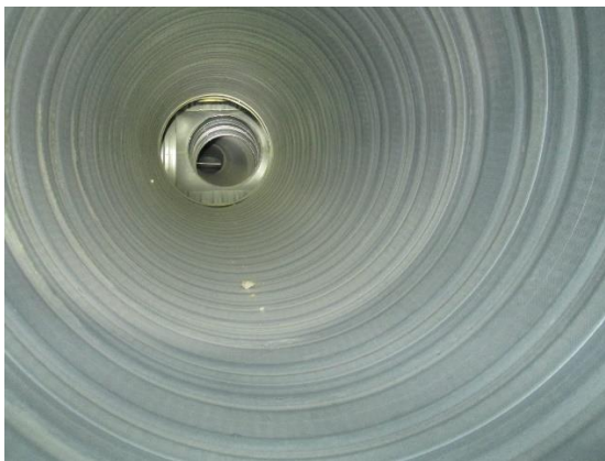
Kuva 38. Yleispoistokanavia. Itäosan kanavassa betonipalasia, mutta irtopölyn määrä vähäinen, alle 0,5 g/m 2 .
