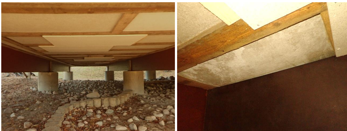
Kuva 9. Ryömintätilalliseen alapohjaan oli lisätty useita tuulensuojalevyjä. Ryhmätilan 10 viemäröinnin kohdalla yksi alapohjan tuulensuojalevyistä oli kirjava ja tähän tehtiin rakenneavaus RA20 alhaalta päin.
