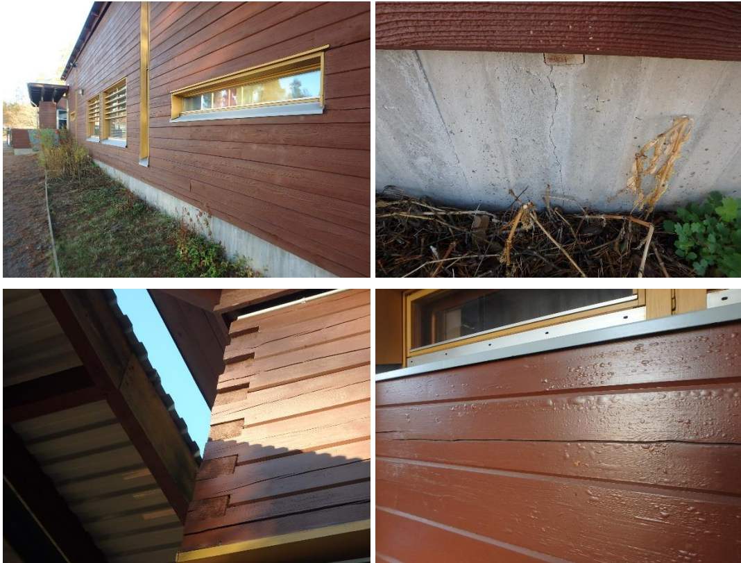
Kuva 18. Julkisivut olivat aistinvaraisesti arvioiden hyväkuntoiset. Hirsiverhoilu oli halkeillut ja ristinurkkien liitokset olivat paikoin liikkuneet. Sokkelissa havaittiin yksittäinen halkeama. Eteläjulkisivulla oli istutusalue sokkelin vieressä. Itäjulkisivulla katoksen alla pellavamaalipinta kupruili. Julkisivut ovat maalattu parin vuoden sisällä.
