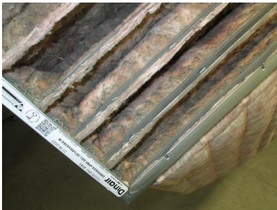
Kuva 20. TK1 tuloilmasuodatin on ePM1 65 % -luokan suodatin. Suodattimet olivat varsin likaantuneita ja niiden takapinta on tummentunut.
