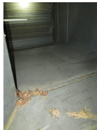
Kuva 17. TK1 ulkoilmakanava ja -pelti.
