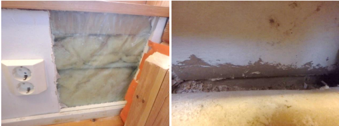
Kuva 14. Ulkoseinärakenteen tekniikkakotelon viereisestä rakenneavauksesta RA4 otetussa materiaalinäytteessä MR3 todettiin mikrobikasvustoa. Tuulensuojalevyn ja sokkelin välissä on rako.
