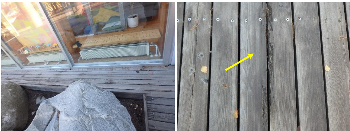
Kuva 21. Rakennuksen itä-, etelä- ja länsipuolella on terassit, joita ei ole huoltokäsitelty ja yksittäisissä laudoissa on lahoa. Etelän puoleinen terassi on kiinni korkean osan lasiseinässä ja samassa tasossa sisätilojen lattiapinnan kanssa. Maanpinta on arviolta samassa tasossa rakennuksen alapohjan betonilaatan yläpintaan nähden. Terasseilta todennäköisesti ohjautuu vettä ulkoseinärakenteisiin.
