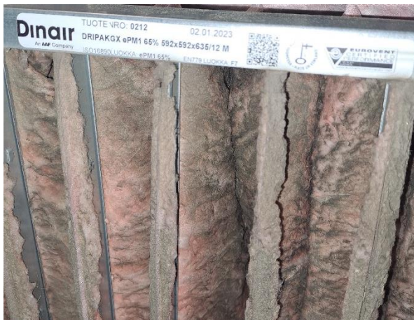
Kuva 35 Tulokoneen TK1 raitisilmasuodattimet ovat likaiset
