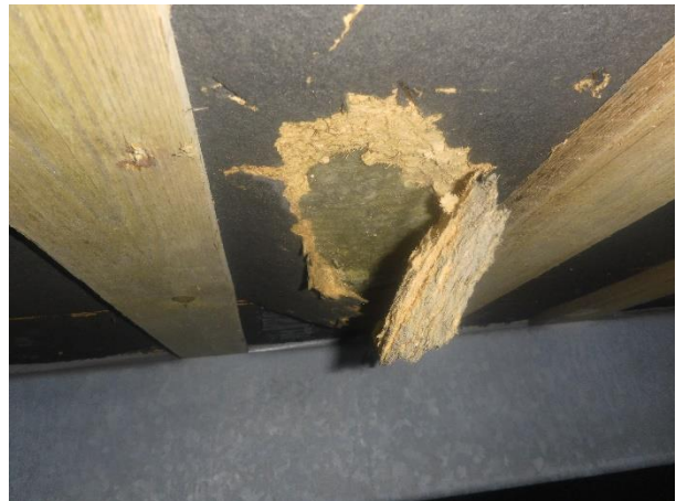
Kuva 11. Alapohjan alapinta vaurioitunut.
