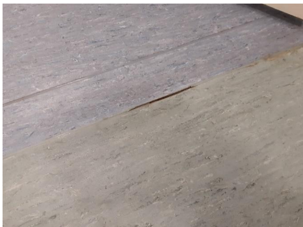
Kuva 4. Ryhmähuone 08:n oviaukon muovimattoliitos epätiivis.
