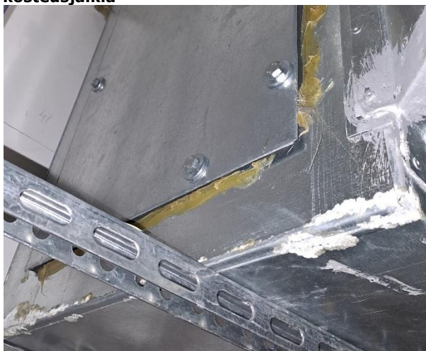
Kuva 26 TK2 tulokoneen raitisilmakammion vaipan kosteusjälkiä
