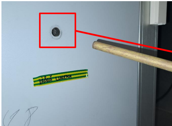
Kuva 33. Lämpömittaria ei oltu kiinnitetty, läpivientireikä oli tiivistämättä
