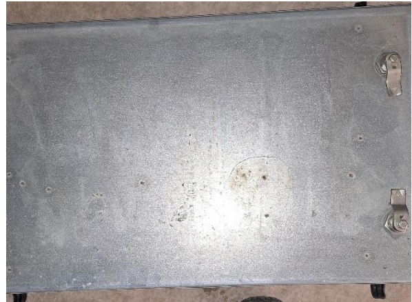
Kuva 28. Kosteusjälkiä TK2 raitisilmasuodatinkammion pohjatarkastusluukussa
