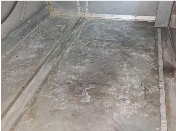
Kuva 27. Kosteusjälkiä TK1 raitisilmasuodatinkammiossa
