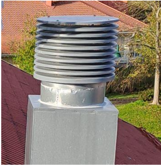
Kuva 37. TK2 raitisilmanottokatos vesikatolla
