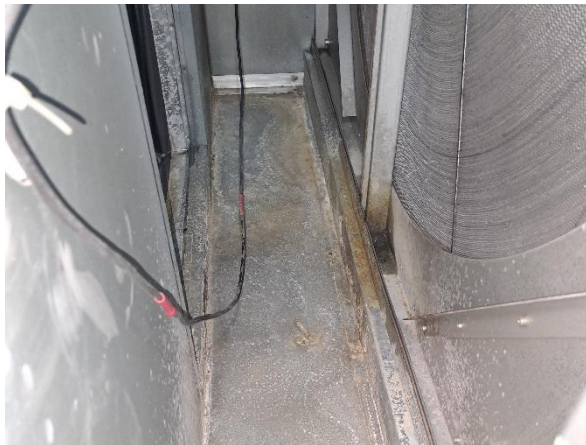
Kuva 29. Kosteusjälkiä TK1 lämmöntalteenoton tarkastuskammiossa
