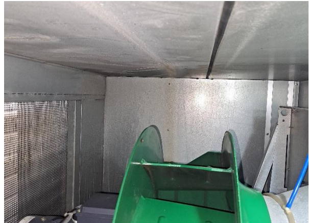
Kuva 31. Veden roiskuminen puhallinpyörästä on jättänyt kammion kattoon kosteusjälkiä
