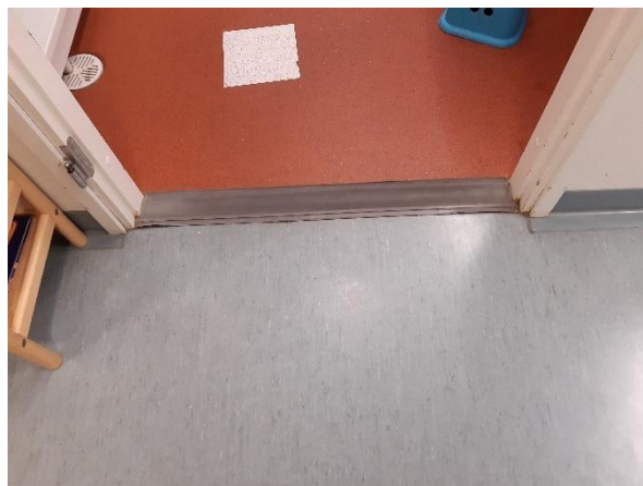
Kuva 5. Pesuhuone 25:n metallinen jalkalista on vääntynyt.
