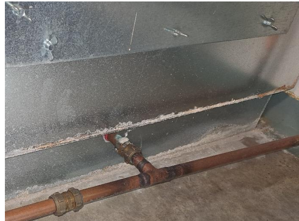
Kuva 25 TK1 tulokoneen raitisilmakammion vaipan kosteusjälkiä
