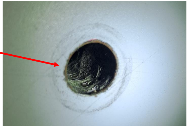
Kuva 34. Konevaipan eristysmateriaalina on käytetty mineraalivillaa. Teollisia mineraalikuituja voi kulkeutua tuloilmanakanavien kautta sisäilmaan.
