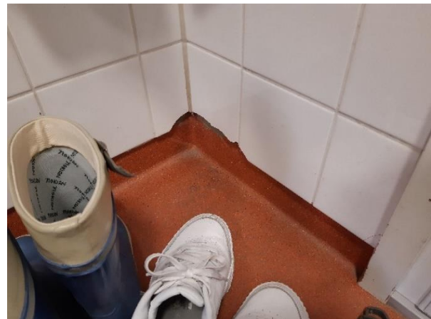
Kuva 3. Kuraeteisen 29 seinän klinkkerilaatat ovat lohjenneet alanurkasta.
