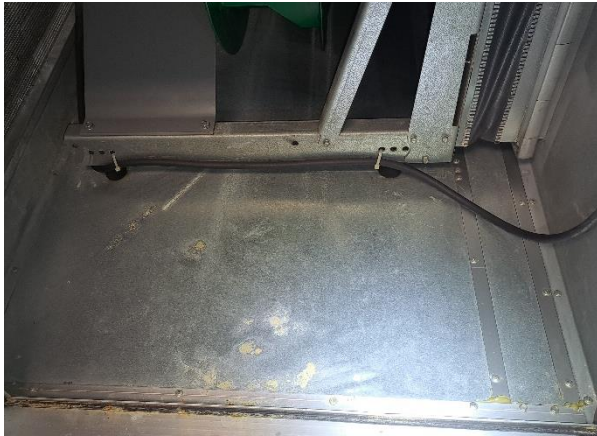
Kuva 30. Kosteusjälkiä TK1 puhallinkammiossa
