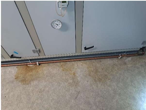
Kuva 24. Koneen TK1 edustalla lattialla on kosteusjälkiä
