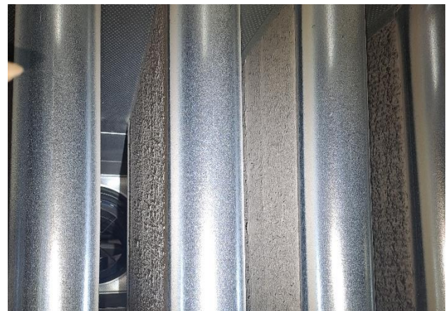
Kuva 36 Poistoilmakoneen äänenvaimennuskammion lamelleissa on runsasta pölykertymää
