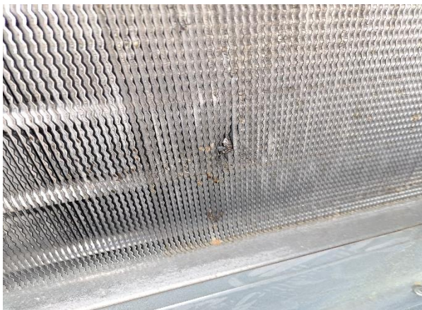
Kuva 32. Kosteusjälkiä TK1 jälkilämmityspatterin lamelleissa
