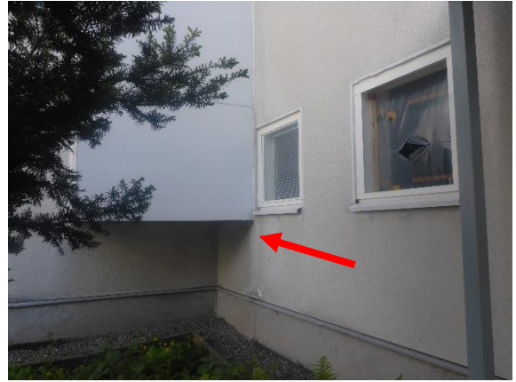
Kuva 16. Sisäpihan rappauksessa on pystyhalkeama.
