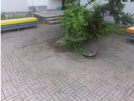
Kuva 44. Sisäpihan kivetys on vajonnut sadevesikaivon ympärillä.
