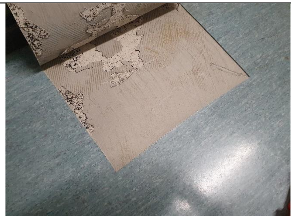
Kuva 12. Tasoitteen alla on vanhan muovimaton mustaa liimaa, sisältää asbestia.
