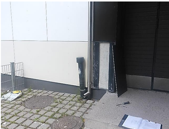
Kuva 19. Vanhan julkisivun maalipinta on lohjennut.
