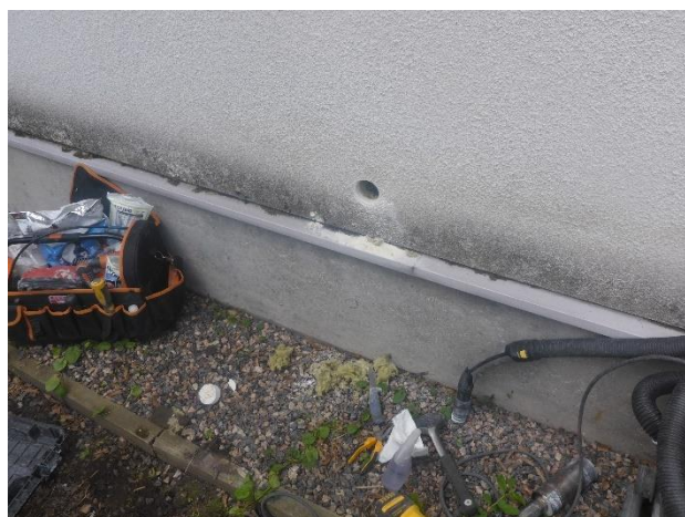
Kuva 5. RA-US4 tehtiin rapatun ulkoseinän alareunaan.
