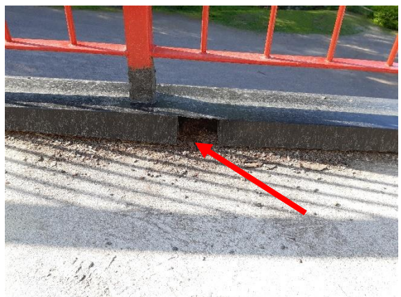
Kuva 49. Eteläpuolen terassin vedenpoisto on tukossa.
