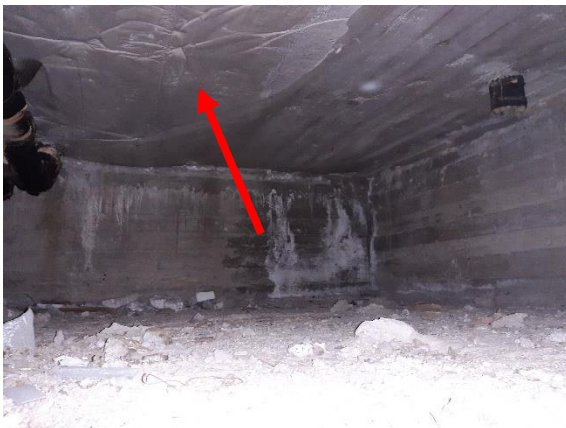
Kuva 9. Ryömintätilan betonirakenteiden pinnassa kalkkihärmettä. Alapohjan alapinnassa muovikalvo.
