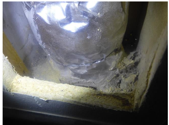
Kuva 34. Kotelon alareuna on pölyinen. Kipsilevyssä ei havaittu kosteusjälkiä.
