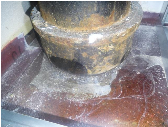
Kuva 37. Alkuperäisen valurautaputken ulkopinta on ruostunut.
