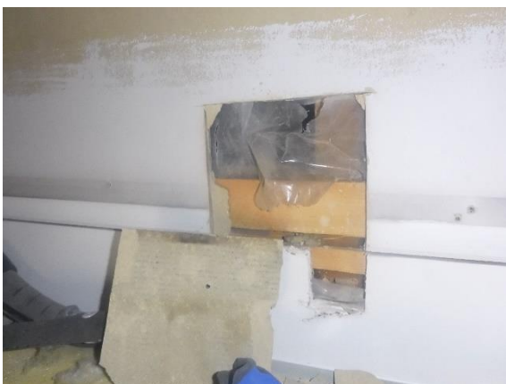
Kuva 25. Ulkoseinärakenne US-7 on puurunkoinen ja mineraalivillaeristetty. Levyn ulkopinnassa tummia jälkiä.
