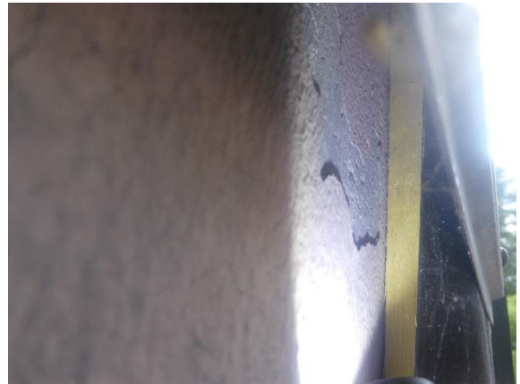
Kuva 18. Vanhan julkisivun maalipinta on lohjennut.
