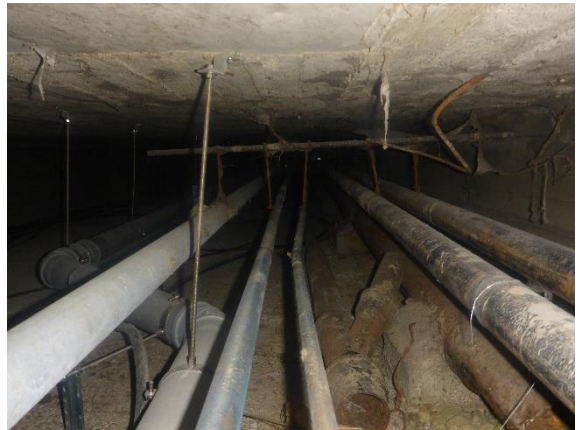
Kuva 8. Putkikanaalin putkikannakkeet ovat korroosiotilassa.
