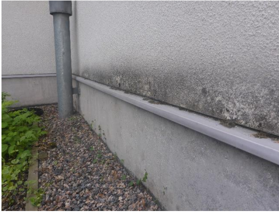
Kuva 15. Sisäpihan rappauksen alareunassa kosteusjälkiä.
