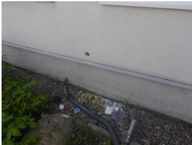
Kuva 9. RA-US5 tehtiin rapatun ulkoseinän alareunaan.
