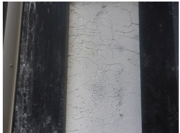
Kuva 20. Vanhan julkisivun maali on halkeillut
