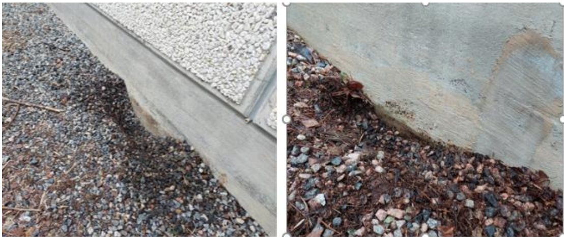
Kuvat 6 a ja b. Muilla sivuilla perusmuurin ulkopinnalla ei havaittu perusmuurilevyä tai muuta kosteuseristystä.
