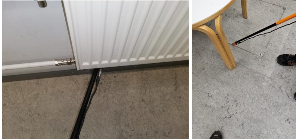
Kuva 68. Patterin alemmasta kannakkeesta vuoti ilmaa. Lattialuukun kannen reunasta havaittiin vähäinen ilmavuoto.
