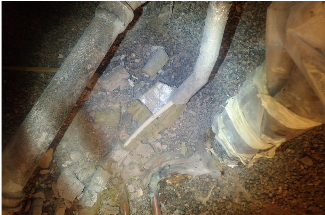
Kuva 19. Tarkastusluukku L3. Osa putkiasennuksista ja kannakoinneista oli epämääräisiä. Putkieristeet olivat rikkoutuneet.
