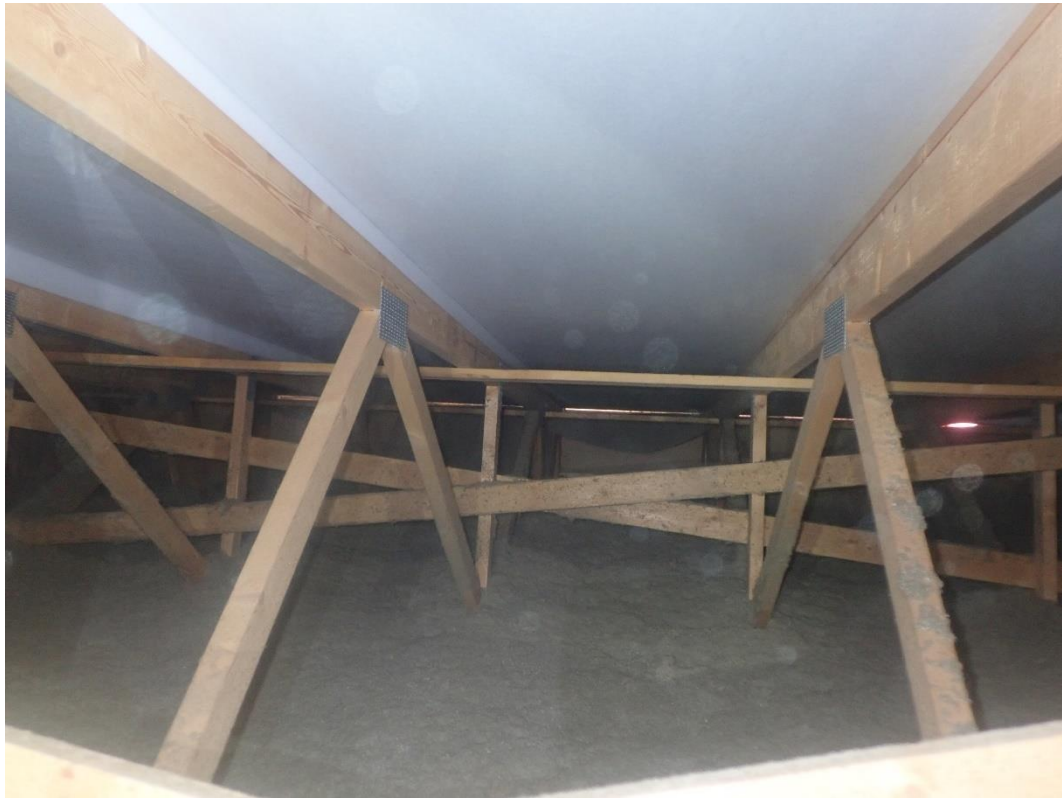
Kuva 50. Paviljonkirakennus. Yläpohjan eteläpääty oli yleisilmeeltään siisti. Lämmöneristeenä oli puhallusvilla (ekovilla). Aluskate ulottuu räystäälle asti. Räystäällä on tuuletusraot, joissa pistokoeluonteisen tarkastuksen perusteella havaittiin tiheäsilmainen muoviverkko. Räystäällä tuulenohjaimet (kovalevyt) olivat monin paikoin romahtaneet.
