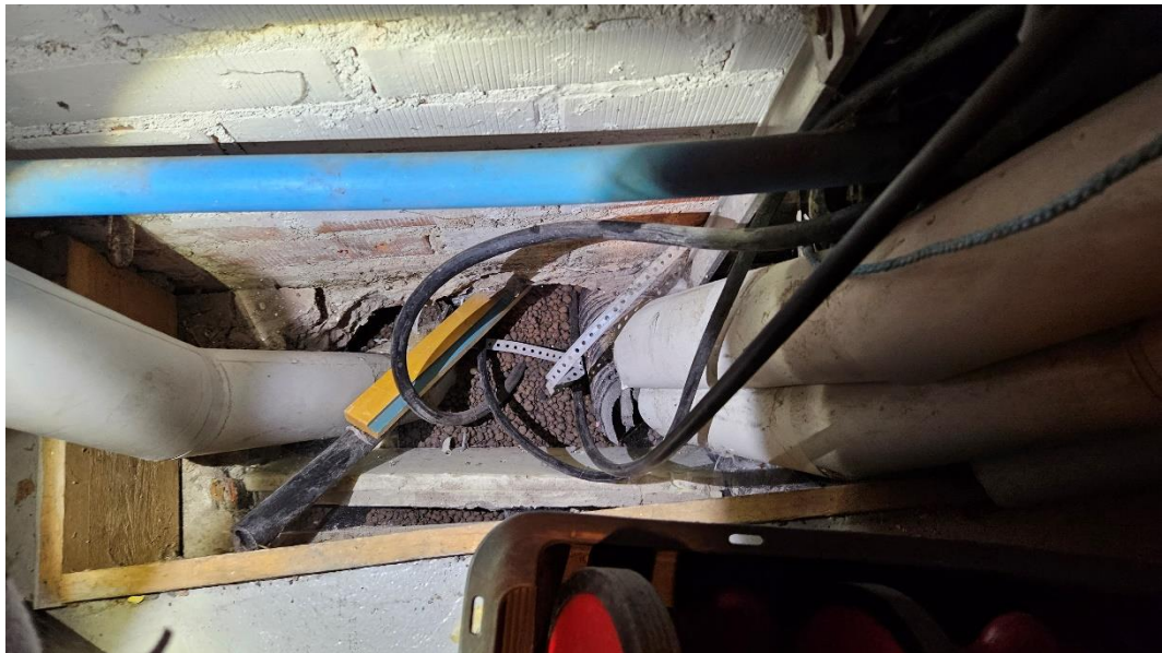
Kuva 11. B-osa, varasto. Alapohjassa avoimia läpivientejä.
