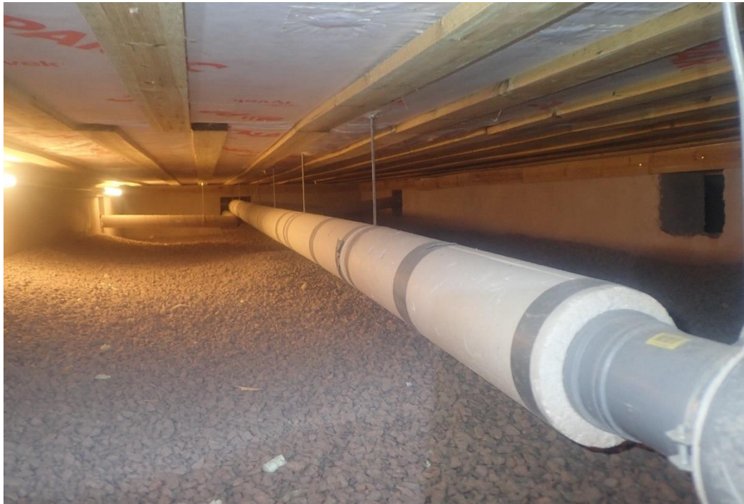
Kuva 28. Paviljonkirakennus. Viemärin sivuttaistuenta oli puutteellinen.
