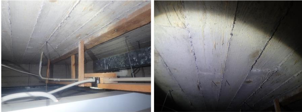
Kuvat 70a ja b. A- osa, käytävä. Alakaton yläpuolella havaittiin hieman pölyä. Välipohja paikalla valettua betonia, jonka alapinnassa on jäämiä puretuista muottilaudoista.
