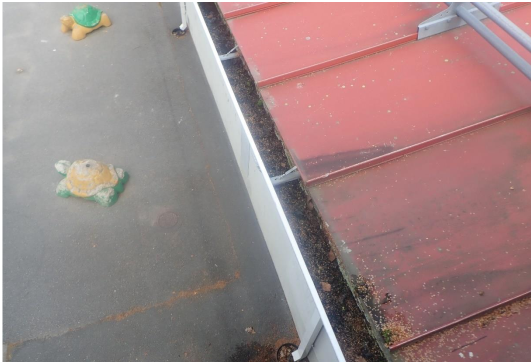
Kuva 55. Paviljonkirakennus. Räystäskouruissa oli runsaasti roskaa.
