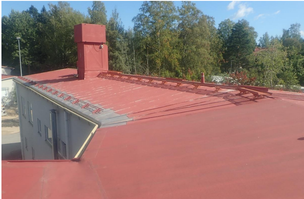
Kuva 46. C-osa. Konesaumattu peltikate. Räystäitä on korjattu v. 2015.
