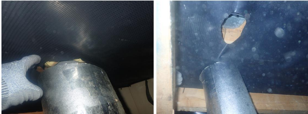
Kuva 48. C-osa. a) Yläpohjassa aluskate läpivientien kohdalla epätiivis. b) Aluskatteessa aukko vanhan käytöstä poistetun läpiviennin kohdalla. Lämmöneristeet alapuolella oli aistinvaraisesti arvioituna kuivia eikä viitteitä haitallisesti kastumisesta havaittu. Räystäällä aluskate on korjattu ulottumaan ulkoseinälinjan ulkopuolelle.
