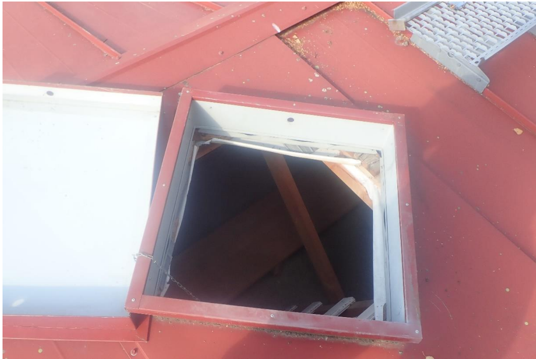
Kuva 54. Paviljonkirakennus. Kattoluukuissa ei ole puurunkoa. Pellitykset joustavat ja liitoksen kattoon ovat epätiivii. Luukun alapuolisissa puuosissa havaittiin kuivuneita kosteusjälkiä.
