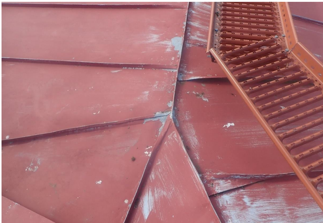
Kuva 47. C-osa. Peltikaton maali on paikoin kulunut. Peltikatolla oli butyyliteipillä tehtyjä paikkauksia vähintään 2 kappaletta. Butyyliteipit olivat osittain irronneet/kuluneet.
