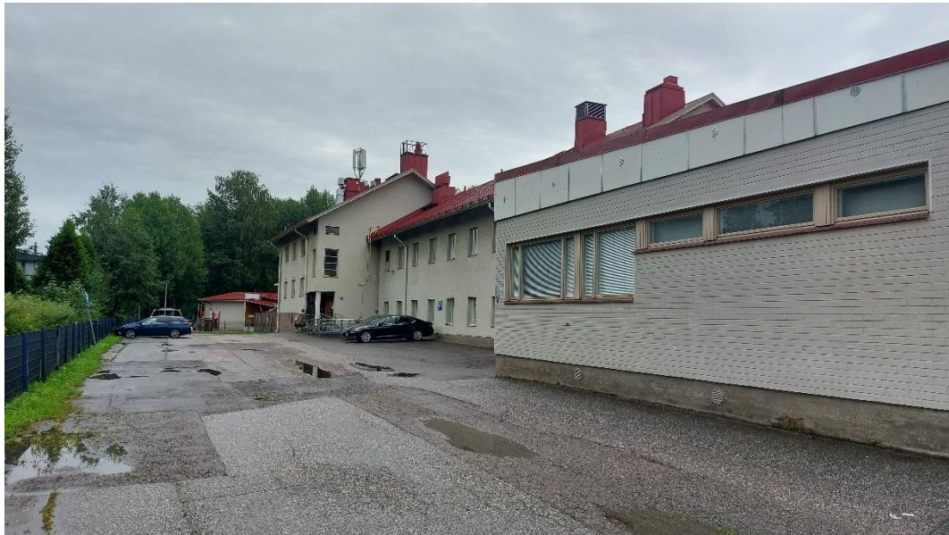
Kuva 5. Vesi lammikoituu paikoin parkkipaikalle B-osan pohjoispuolella. Asfaltissa oli useita paikkauksia.
