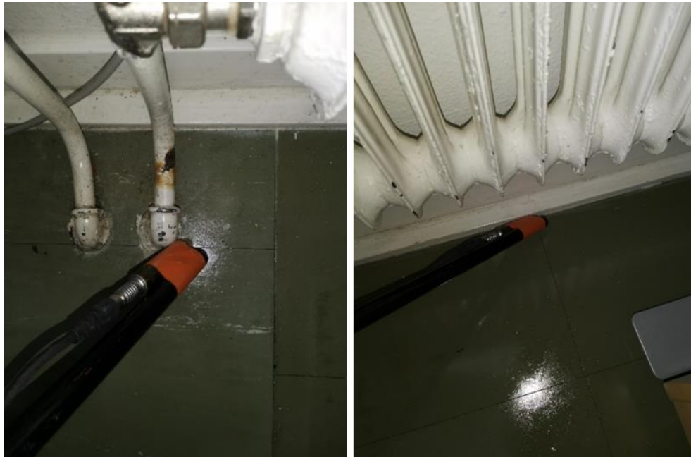
Kuva 64. Vuodot olivat pistemäisiä. Patteriputken juuresta havaittu vuoto oli voimakas.
