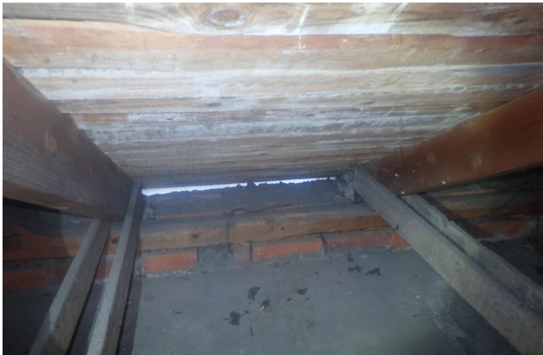
Kuva 40. B-osa, ullakko. Räystäällä tuuletusraossa ei ole pieneläinverkkoa. Ullakolla oli tutkimushetkellä tervapääsky. Ullakolla oli joitain rakennusmateriaaleja/-jätettä sekä paljon pölyä.
