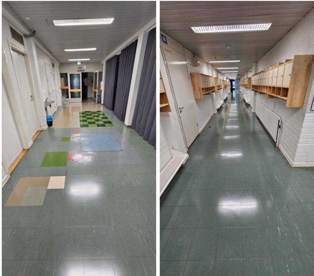
Kuva 8. A-osa. Yleiskuvia käytäviltä. Vinyylilaattoja on paikoin uusittu. Putkikanaalin kulkuluukku on uusittu. Vinyylilaatat 250x250 mm sekä niiden musta kiinnitysliima sisältää asbestia.
