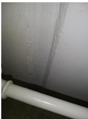
Kuva 67. Elementtisaumassa vähäinen ilmavuoto halkeamasta.
