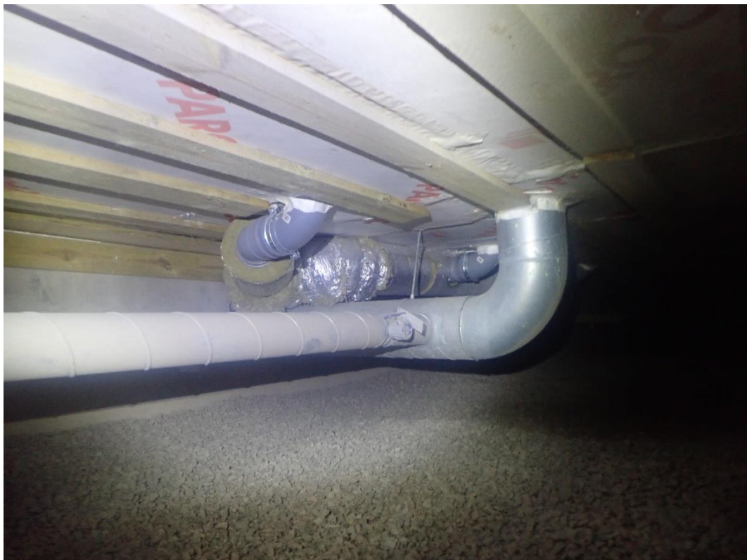
Kuva 29. Paviljonkirakennus. Viemärien lämmöneristys puuttuu läpivientien kohdalla.
