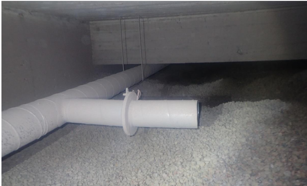
Kuva 21. Tarkastusluukku L4. Ryömintätilassa poistoilmakanavisto. Sepelöinti oli paikoin epätasaisesti levitetty.
