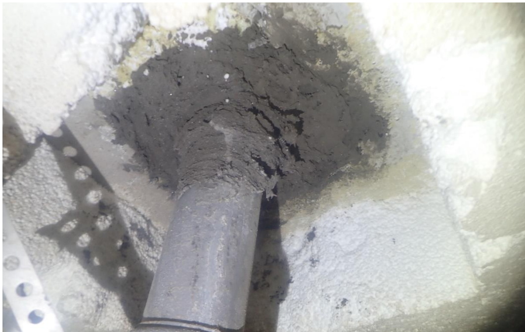
Kuva 25. Alapuolisia läpivientien tiivistyksiä oli tehty vedeneristysmassalla. Tiivistetyt läpiviennit olivat pistokoeluonteisen
