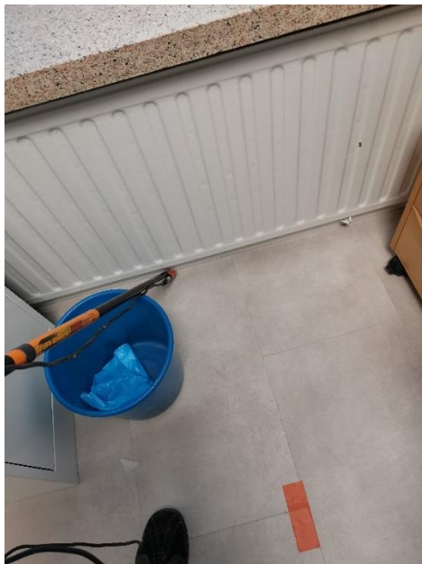
Kuva 65. Lattian ja seinän liitos vuoti voimakkaasti.
