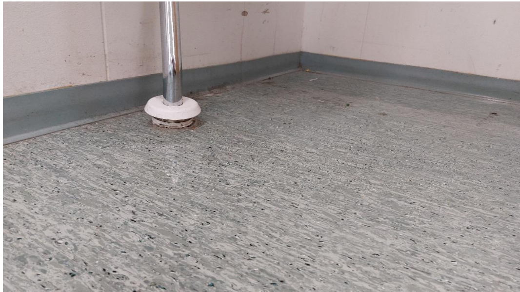
Kuva 16. Paviljonkirakennus. Käsipesualtaiden viemärin lattialäpiviennit olivat useammassa paikassa epätiiviiit.
