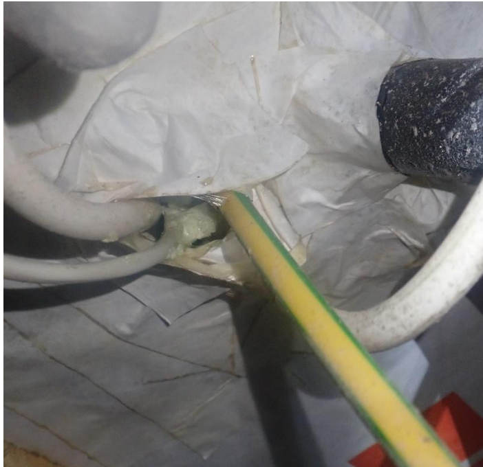
Kuva 30. Paviljonkirakennus. Johtoläpiviennit olivat epätiiviit.
