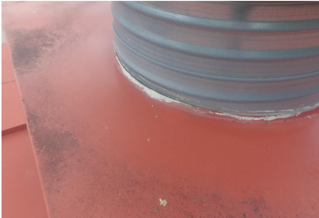
Kuva 56. Paviljonkirakennus. Läpivientien pellitysten tiivistys on ikääntynyt ja epätiivis.
