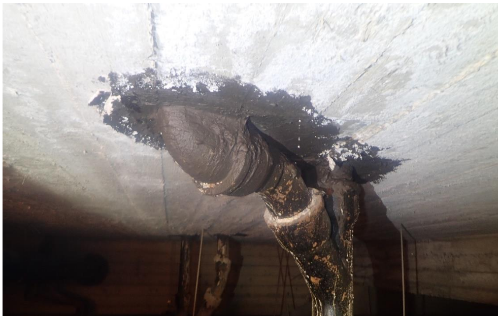
Kuva 20. Alapuolisia läpivientien tiivistyksiä oli tehty vedeneristysmassalla (Ardex 8+9). Tiivistetyt läpiviennit olivat pistokoeluonteisen tarkastuksen perusteella aistinvaraisesti arvioituna tiiviit.
