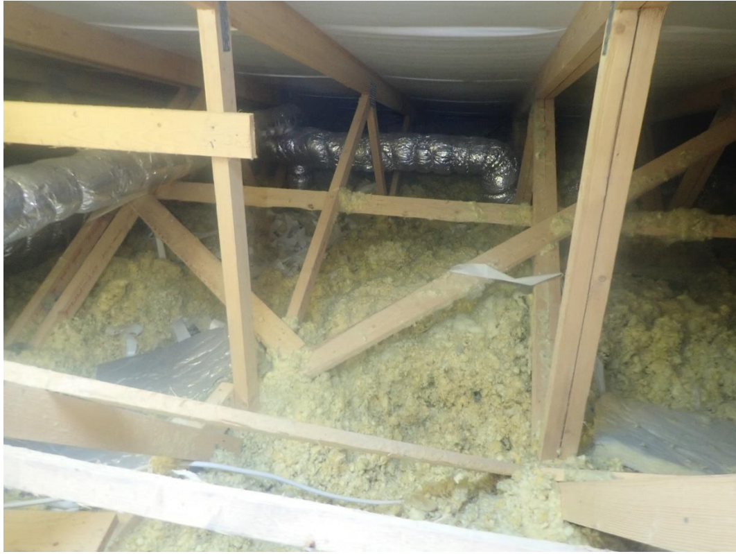
Kuva 51. Paviljonkirakennus. Yläpohjan pohjoispäädyssä oli paikoin rakennusjätettä ja lämmöneristys epätasaista. Lämmöneriste oli painunut monin paikoin yläpohjassa kulkemisen takia. Lämmöneristeenä oli puhallusvilla (mineraalivilla).
