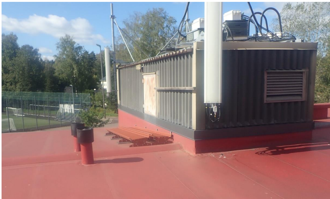
Kuva 42. A-osan vesikatolla on ilmanvaihtokonehuone. Ilmanvaihtokonehuoneen katon reunaliittymät olivat silmämääräisesti epätiiviin oloiset eikä niissä havaittu myrskysuojausta.
