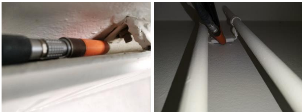
Kuva 63. Patterin ja patteriputkien kiinnikkeistä havaittiin pistemäistä ilmavuotoa.
