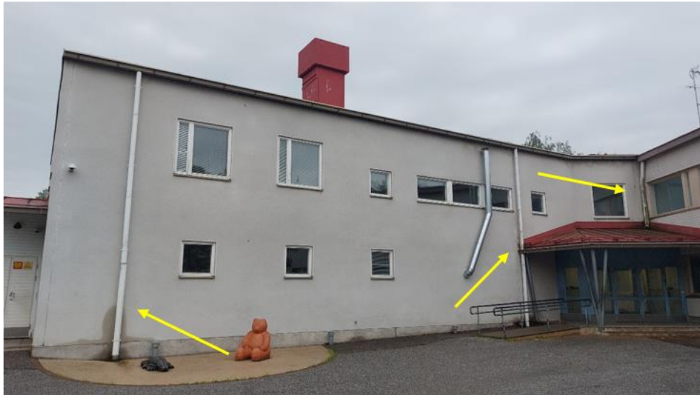
Kuva 7. C-osa. Syöksytorvia mahdollisesti osittain tukossa ja saumaus auennut. Syöksytorven vuoto kastelee julkisivua. Vuotavat syöksytorvet ovat ulkopuolelta likaantuneet vuodon takia.
