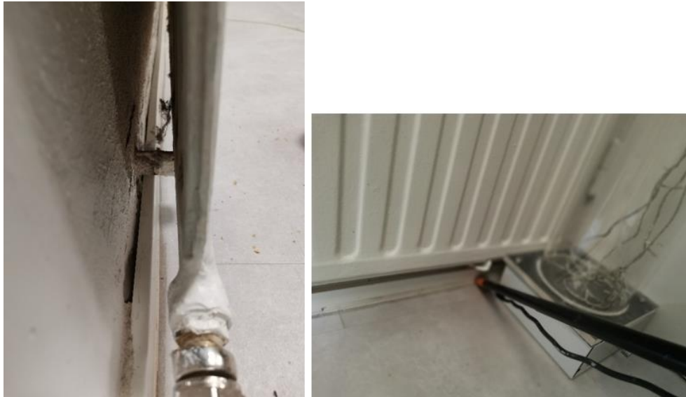
Kuva 62. Lattian ja seinän liitos vuoti voimakkaasti.
