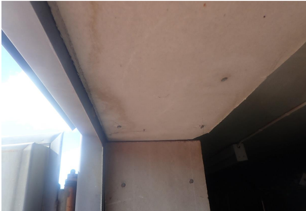
Kuva 43. A-osa. Ilmanvaihtokonehuoneen kattolevytyksissä ja oven pielessä havaittiin kosteusjälkiä.
