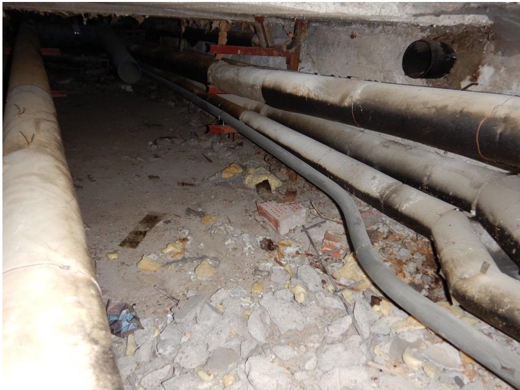
Kuva 23. Tarkastusluukku L8, käytävän putkikanaali. Putkikanaalissa rakennusjätettä ja osittain rikkiäisiä putkieristeitä.
