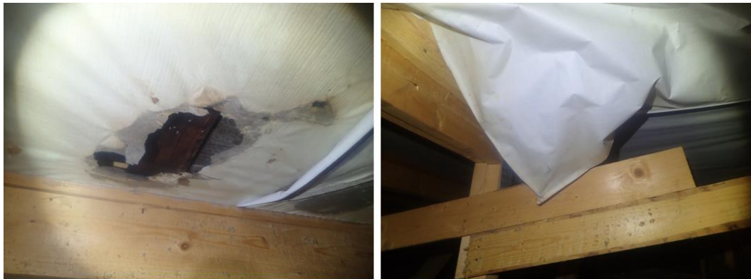
Kuva 53. Paviljonkirakennus. a) Ilmanvaihtokonehuoneen vieressä aluskatteessa havaittiin kosteusjälkiä sekä iso reikä. b) aluskatteen lieve oli auki yksittäisesti kohdasta.
