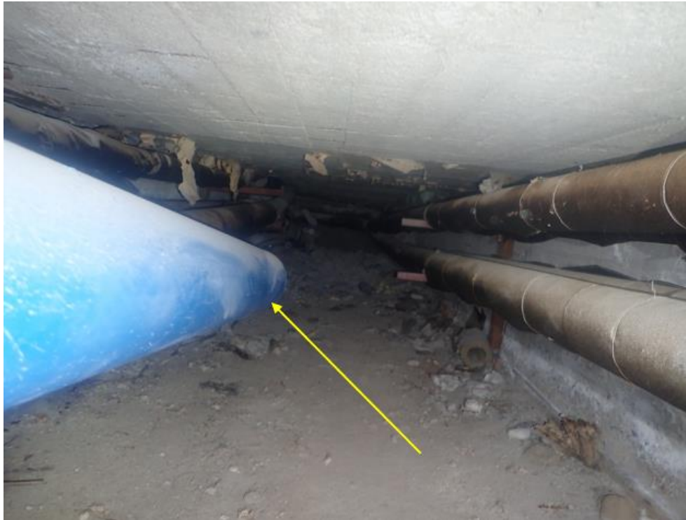
Kuva 17. Tarkastusluukku L1, putkikanaali. Putkikanaalissa rakennusjätettä ja osittain rikkiäisiä putkieristeitä. Kanavan kannakointi puuttuu (keltainen nuoli).
