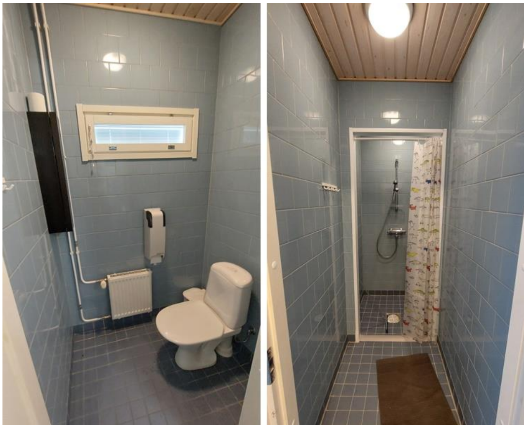
Kuva 15. Paviljonkirakennus. Märkätilat olivat yleisilmeeltään siistit ja pinnat ehjiä.
