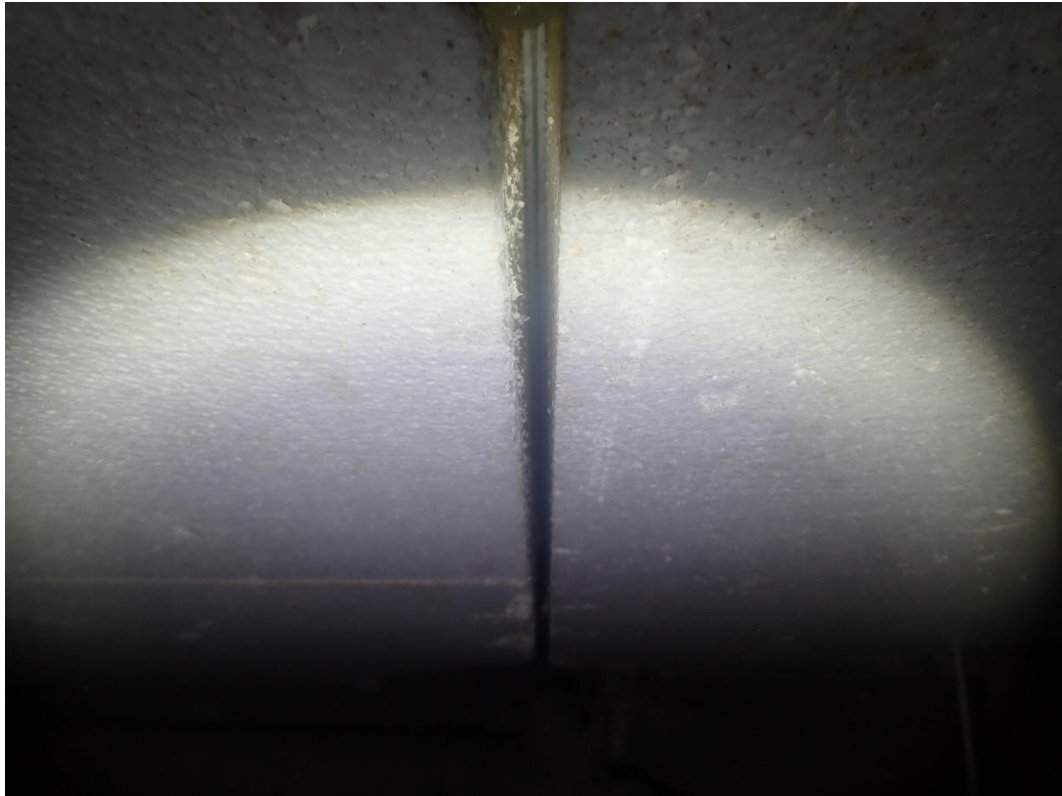
Kuva 26. C-osa. Ontelolaatan alapinnassa olevien lämmöneristeiden saumat olivat avoimet.
