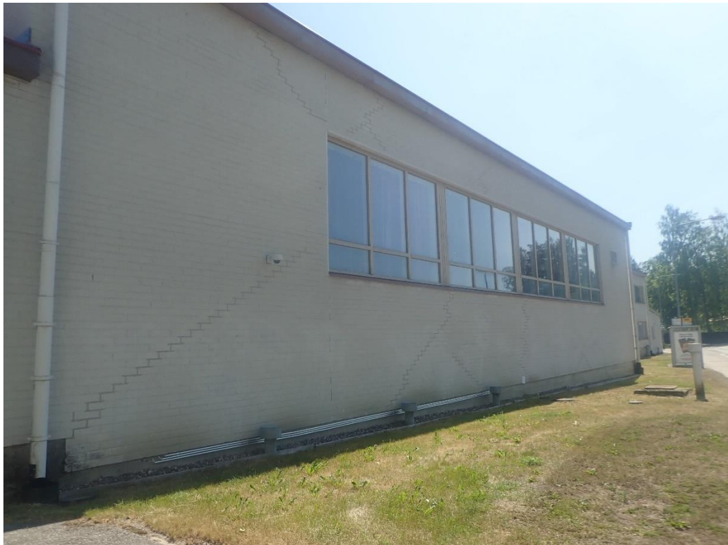
Kuva 37. B-osa, länsijulkisivu. Muurauksessa havaittiin maan painumiseen viittaavaa diagonaalimaista halkeilua.
