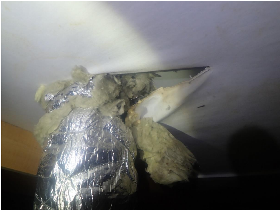
Kuva 52. Paviljonkirakennus. Läpiviennit olivat epätiivä. Läpiviennin kohdalla höyrynsulkumuovin pinnalla oli kuivuneita kosteusjälkiä.
