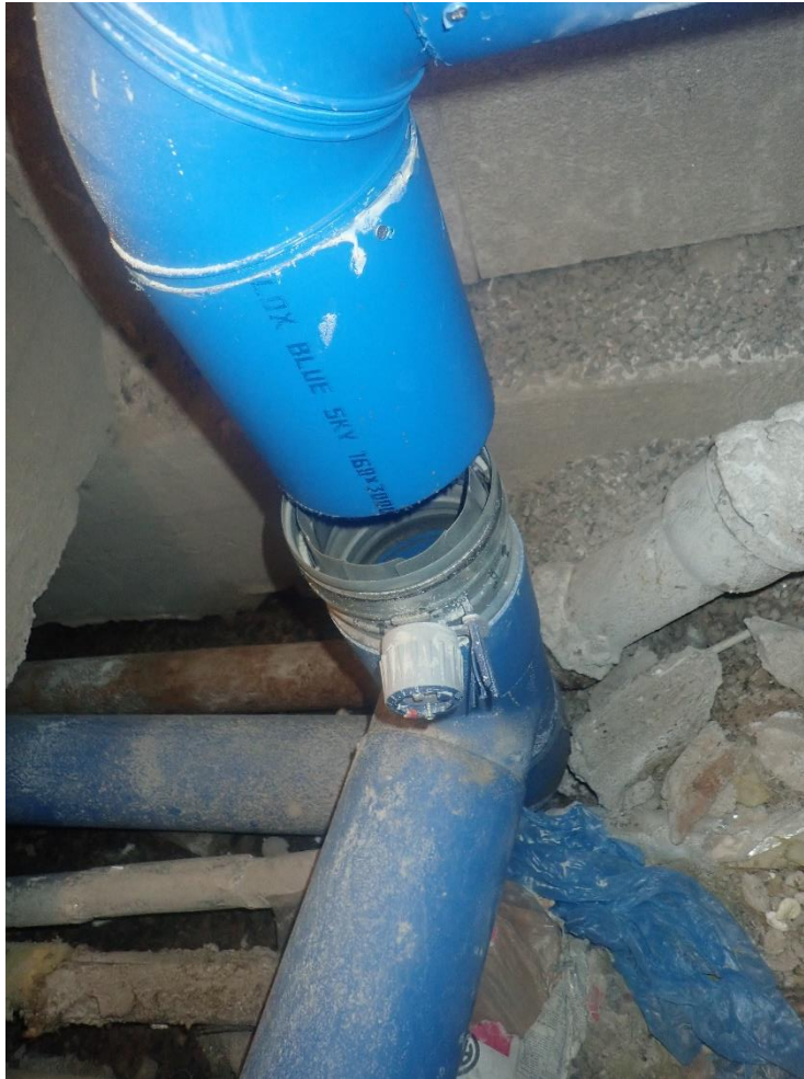
Kuva 18. Tarkastusluukku L3. Kanavan liitos on auki ja kannakointi puutteellinen. Liitos yhdistettiin tutkimuksen aikana väliaikaisesti ja ilmoitettiin huollolle.
