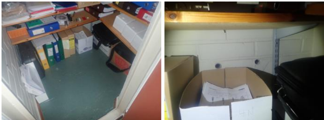
Kuva 71a ja b. A- osa, arkisto 214B. Arkistotilassa on käyttäjien mukaan ollut poikkeava haju. Tarkastushetkellä tilassa ei havaittu poikkeavaa hajua. Tilassa on varastoitu vanhoja papereita/mappeja. Tilassa havaittiin toimiva poistoilmanvaihto, mutta ei selkeää korvausilmaa. Väliseinän alaosassa hyllyjen alla havaittiin kaksi avointa putkiläpivientiä, joista oli selvä ilmavirtaus huoneeseen päin.
