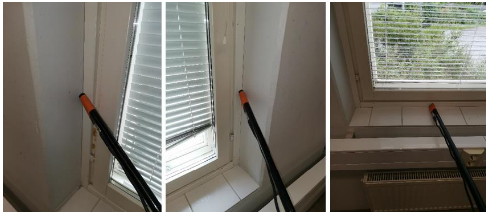
Kuva 66. Ikkunan tilkeväleistä havaittiin ilmavuotoa kaikista tutkituista ikkunoista
