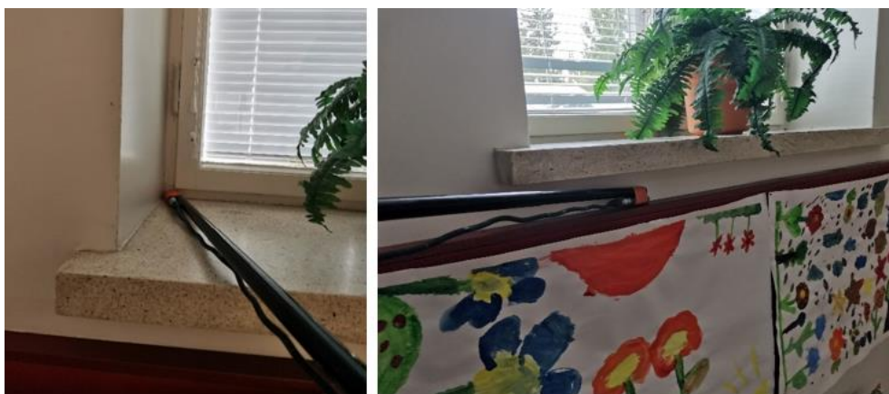
Kuva 61. Ilmavuotoa ikkunan ja seinän liitoksesta ja ilmoitustaulun kannakkeista.
