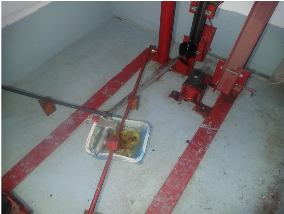
Kuva 13. C-osa, hissikuilun pohja. Hissikuilun pohja oli maalattu ja reunat aistinvaraisesti arvioituna tiiviit. Hissinä on alkuperäinen hydraulinen hissi. Hissikuilun pohjalla on öljyastia.
