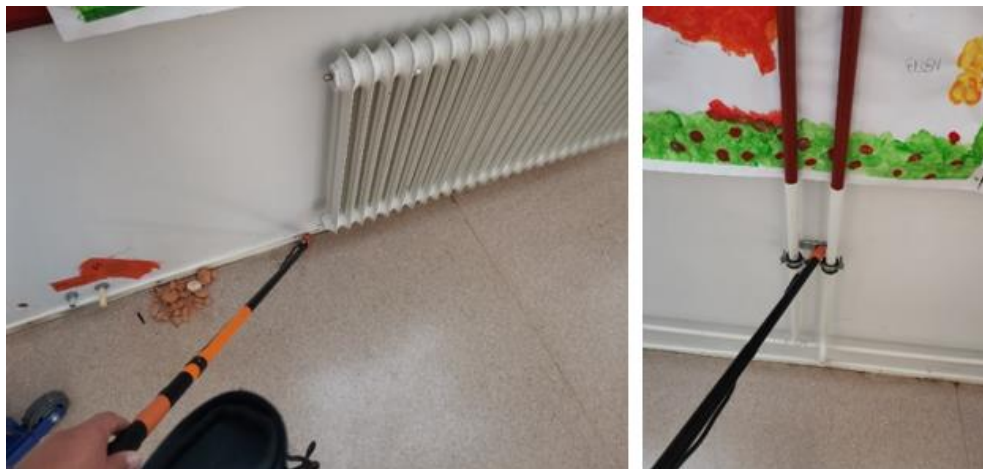
Kuva 60. Ilmavuotoa ulkoseinän ja lattian liitoksesta ja seinän kiinnikkeistä.
