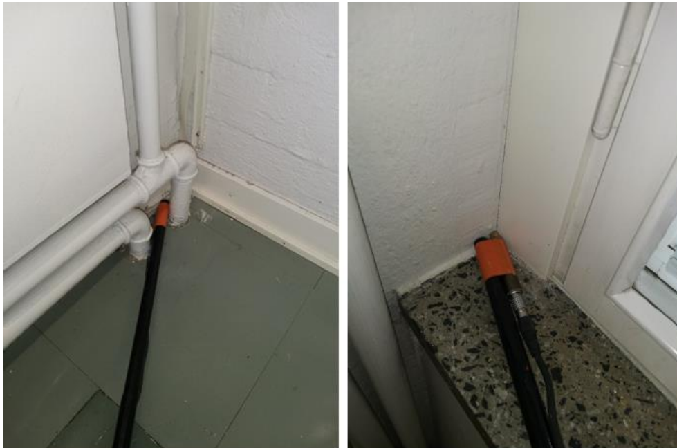
Kuva 58. Patteriputken takaa havaittiin pistemäinen ilmavuoto. Ikkunapenkin vasemmassa nurkassa havaittiin pistemäinen ilmavuoto.
