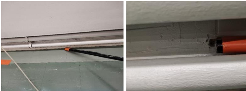
Kuva 57. Heti tiivistyksen yläpuolelta, muurauksen saumoista, havaittiin yksittäisiä pistemäisiä ilmavuotoja.
