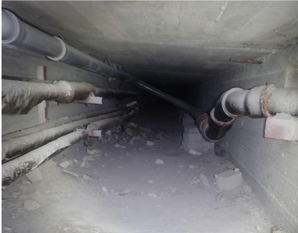
Kuva 22. Tarkastusluukku L5, käytävän putkikanaali. Putkikanaalissa rakennusjätettä ja osittain rikkinäisiä putkieristeitä sekä käytöstä poistettuja putkieristeitä. Putkia on osittain tuettu tiililadonnan päälle.
