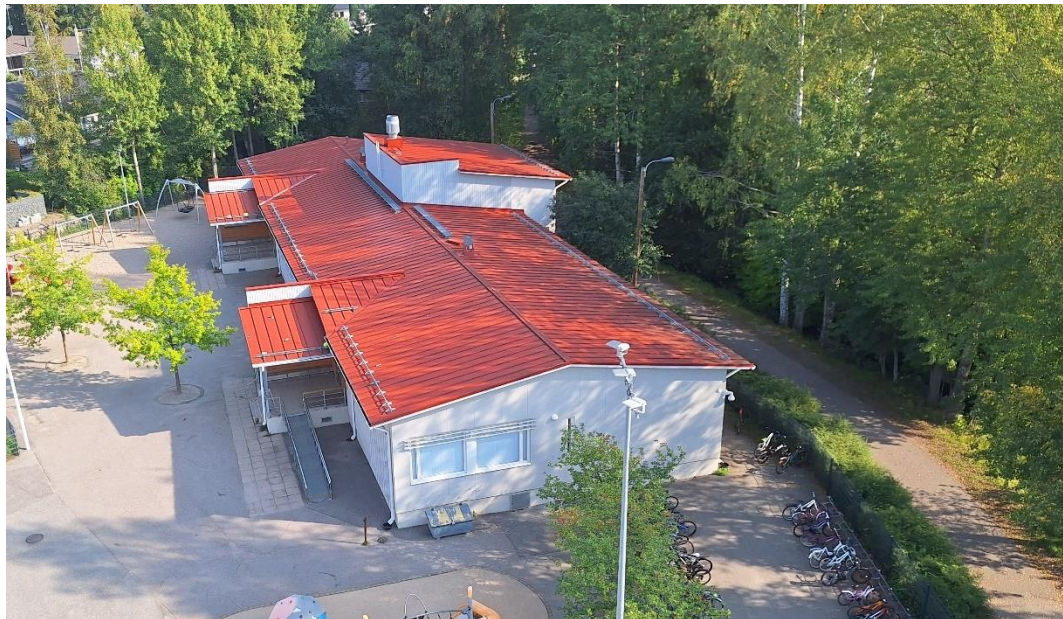
Kuva 49. Paviljonkirakennus. Rakennuksen katolla ei ole pääsyä. Talotikkaat on lähtötietojen mukaan poistettu ilkvallan takia. Ilmanvaihtokonehuoneen katolle johtavista tikkaista puuttuu yläkaari.
