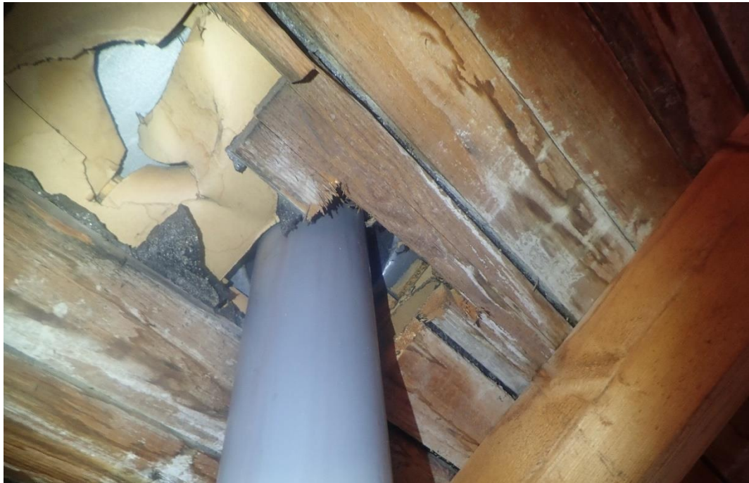
Kuva 39. B-osa. Ullakon läpiviennissä havaittiin vesikatolla vanhaa bitumikermiä (sisältää asbestia) laudoitusten välissä.
