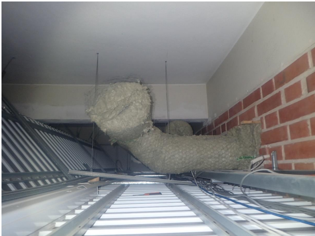
Kuva 69. A-osa, käytävä. Alakaton yläpuolella oli suojaamatonta mineraalivillaa kanavien ympärillä.
