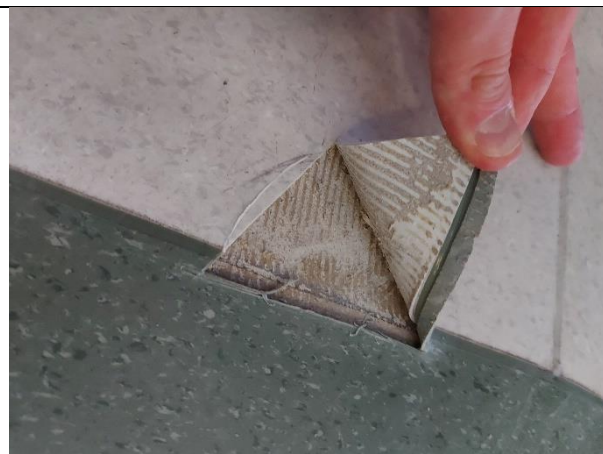
Kuva 10. Ruokalan (VM8) muovimaton liimakerros. Tartunta alustaan heikko. Kyseisessä kohdassa oli näkyvissä kupla.
