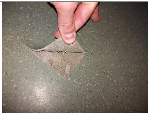
Kuva 4. Tilan 2.092 (VM2) muovimaton liimakerros. Muovimaton alla oli kostean betonin hajua.
