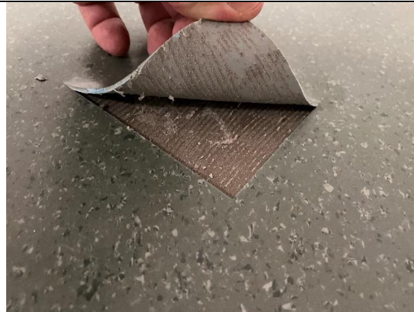
Kuva 8. Tilan 2.036 (VM6) muovimaton liimakerros. Muovimaton alla kostean betonin hajua. Tartunta mattoon heikko.
