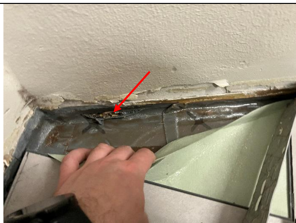
Kuva 7. Tilan 2.093 lattian päällysteen taustan tarkastuskohta. Vahvikenauha on rikkoontunut.
