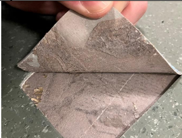
Kuva 7. Tilan 2.067 (VM5) muovimaton liimakerros. Tartunta alustaan heikko. Kyseisessä kohdassa oli näkyvissä kupla.
