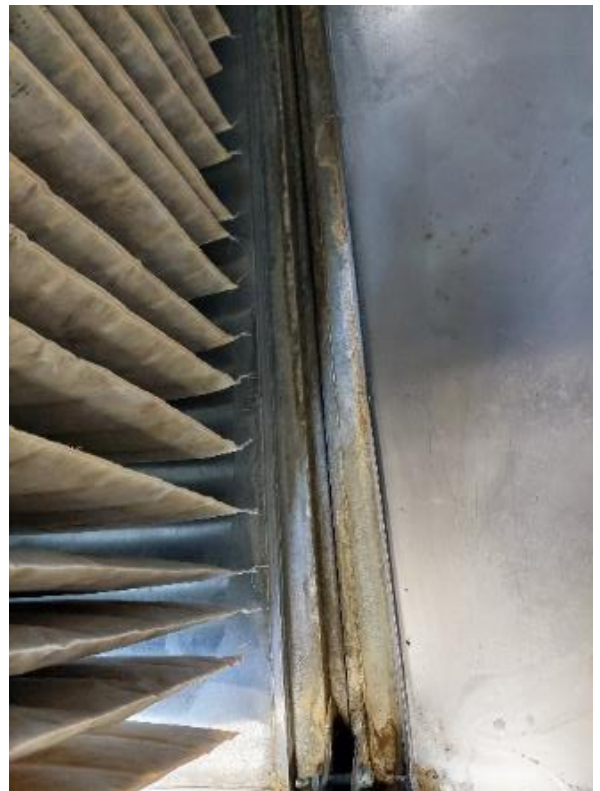
Kuva 196 TK05 kondenssivettä on päätynyt kammioiden väliseen osaan aiheuttaen vauriojälkiä viemäroinnistä huolimatta.
