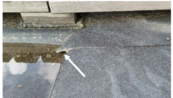
Kuva 149 Paikallisesti kermin kiinnitys on irronnut alustasta.
