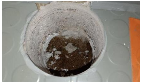
Kuva 57 Rakenneavauksen AP3 perusteella materiaalivaraston alapohjan rakenne ei vastaa alkuperäisiä rakennesuunnitelmia. Rakenteessa on ohut 25 mm EPS-eriste.
