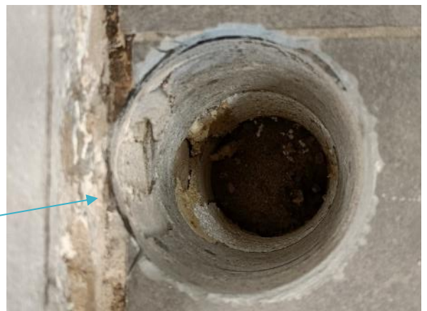
Kuva 120 Tilaan B035 tehdyn rakenneavauksen perusteella tiiliväliseinän perustus (vanha ulkoseinälinja) jatkuu alapohjarakenteen alapuolelle ja on kosketuksissa kostean täyttömaan kanssa.
