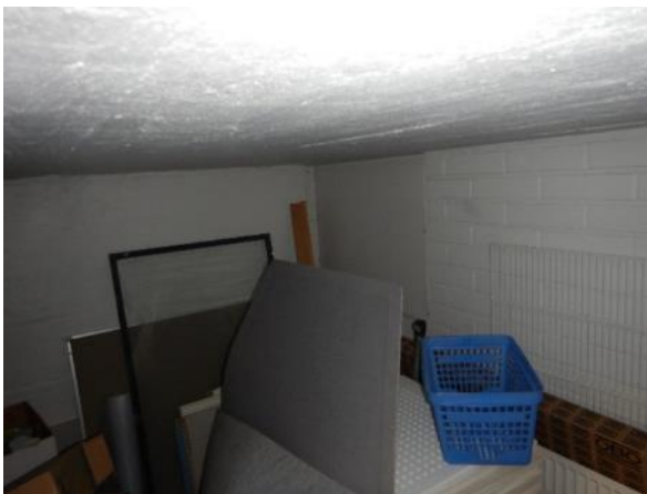
Kuva 176 Säleikön kohdalla sisäpuolella on epätiivis peitelevy.
