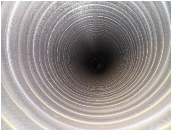
Kuva 200 Ilmanvaihtokoneen TK07 yläpuolisessa raitisilmakanavassa on hieman siitepölyä.
