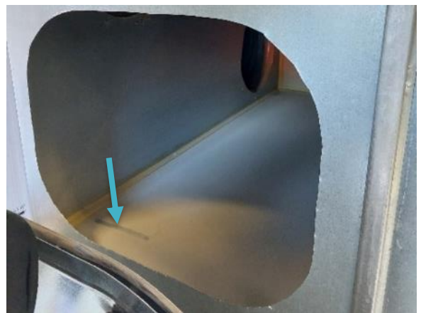
Kuva 203 Koneen TK2 poiston äänenvaimennuskammioon jää selvä jälki kammion pölykerrokseen.
