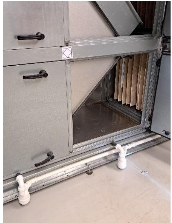
Kuva 194 Muissa ilmanvaihtokoneissa on kenno-mainen lämmöntalteenotto.
