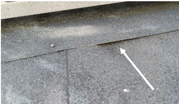
Kuva 148 Paikallisesti kermin kiinnitys on irronnut alustasta.
