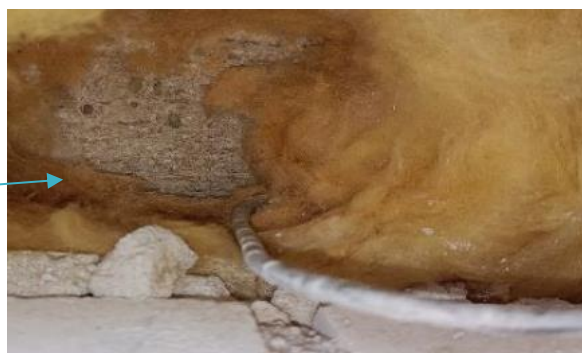
Kuva 22 Rakenteessa ei ole sisäpuolista vedeneristystä.
