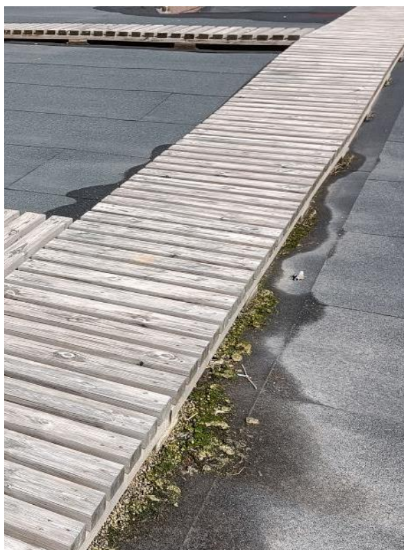
Kuva 158 Sammalta kasvaa kattosillan vieressä.
