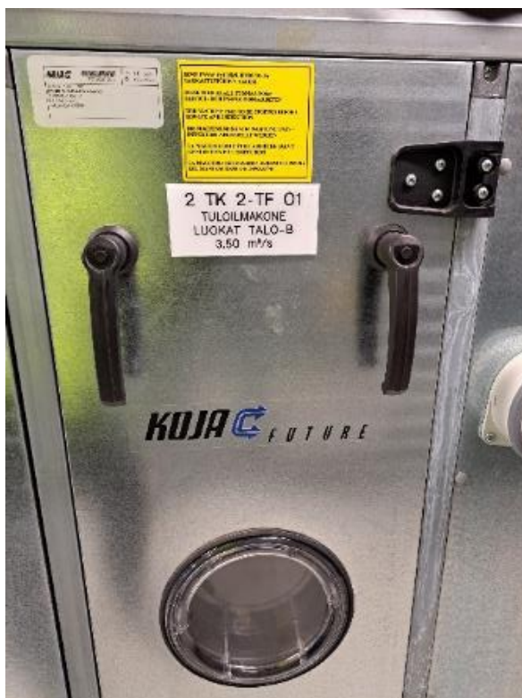
Kuva 189 Yleiskuva ilmanvaihtokoneen kammion tarkastusluukusta. Koneissa on ilmoitettu suunnitteluarvot.
