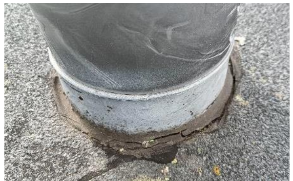
Kuva 151 Läpiviennin bitumimassa on kovettunut ja halkeillut.
