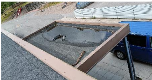
Kuva 159 Sisäpihan puoleisten sisäänkäyntien katosten vedenpoisto on tukkeutunut.
