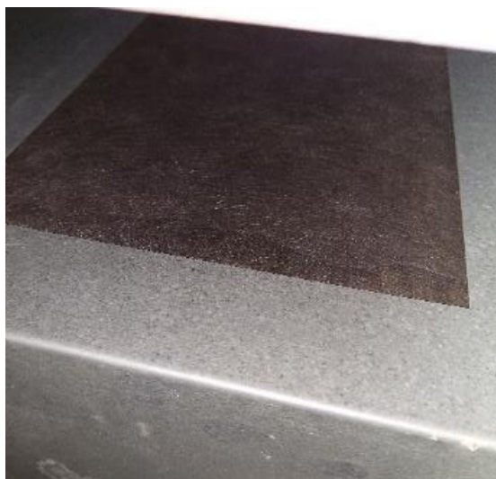
Kuva 192 Tulopuolen äänenvaimentimien mineraalivilla on suojattu mustalla harsolla. Tulokanavien äänenvaimentimissa ei ole pölyä.
