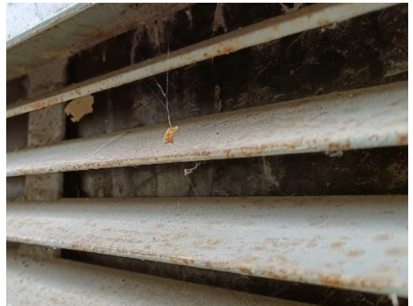
Kuva 175 Lähikuva säleikön takana olevasta eristeestä.
