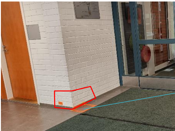
Kuva 119 Käytävän B035 ja tilan B037 välisessä (vanha ulkoseinälinja) seinässä esiintyy poikkeavaa kosteutta.
