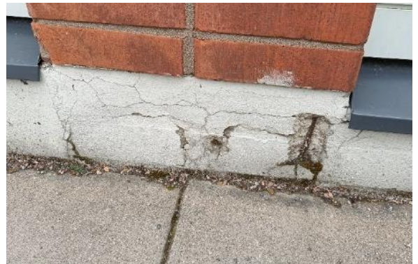
Kuva 83 Sokkelissa esiintyy korroosiovauriota.
