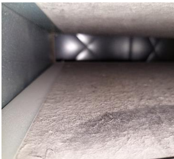
Kuva 191 Poistokanavan äänenvaimentimissa on pölyä, TK08.
