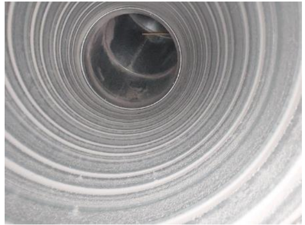
Kuva 201 Ilmanvaihtokoneen TK08 tulokanavaa, joka on aistinvaraisesti puhdas.
