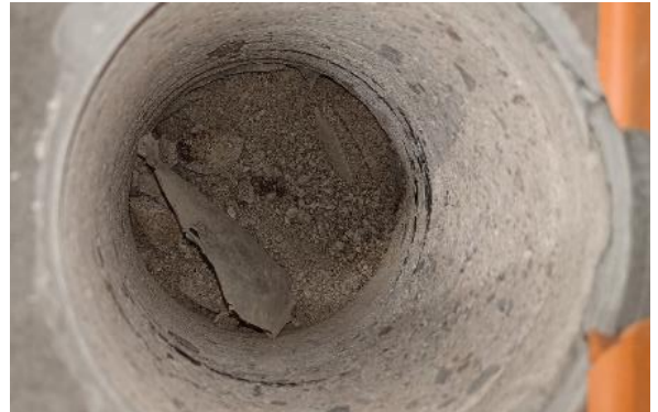
Kuva 61 Rakenneavauspisteessä AP5 ei todettu lämmöneristettä eikä rakennesuunnitel- mien mukaista lecabetonia. Betonilaa- tan alla oli muovikalvo.
