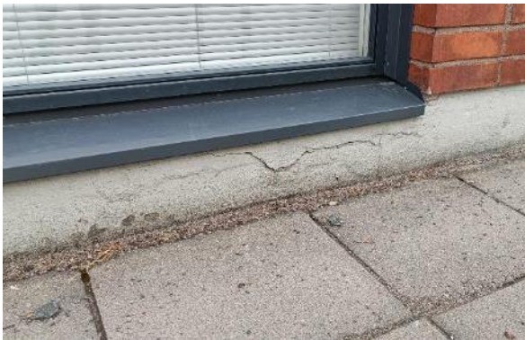
Kuva 82 Sokkelissa esiintyy korroosiovauriota.
