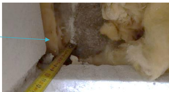
Kuva 20 Rakenteessa ei ole vuoden 1997 suunnitelmien mukaista sisäpuolista vedeneristystä.
