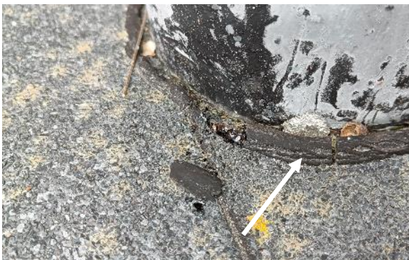
Kuva 150 Läpiviennin bitumimassa on kovettunut.
