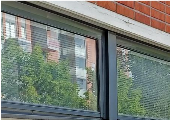
Kuva 93 Ikkunanylityspalkissa on korroosiovauriota.
