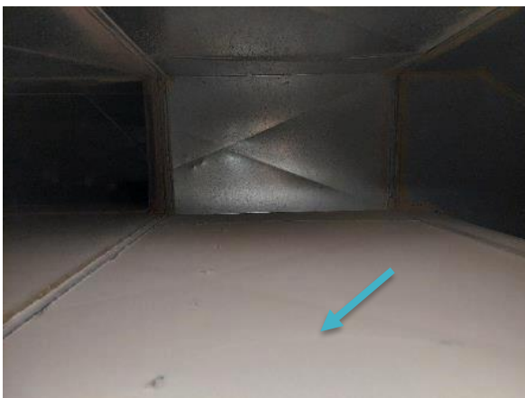
Kuva 202 Poistokanavan pölyisyys ilmanvaihtokoneen TK06 konehuoneessa. Pyyhintäjälki on osoitettu nuolella.
