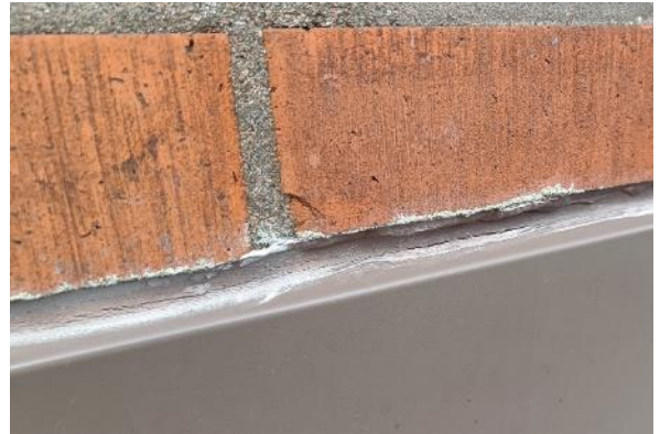
Kuva 162 Liikuntasalin ulkoseinälle tehdyn ylösnoston tiivistysmassaus on alkanut halkeilla.
