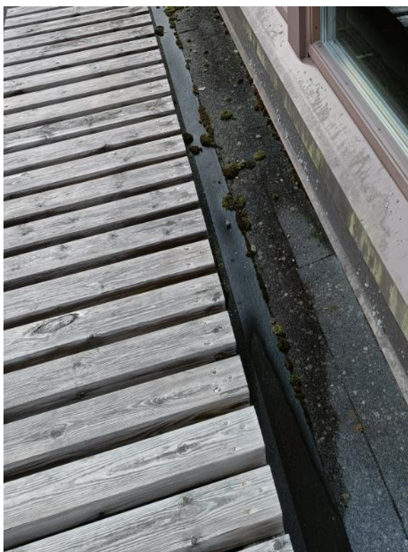
Kuva 157 Sammalta kasvaa kattoikkunan vieressä.
