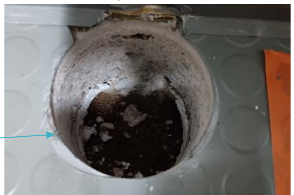
Kuva 122 Kosteaksi todetut betonirakenteiset väli-seinärakenteet jatkuvat alapohjarakenteen alapuolelle ja ovat kosketuksissa kostean pohjamaan kanssa.
