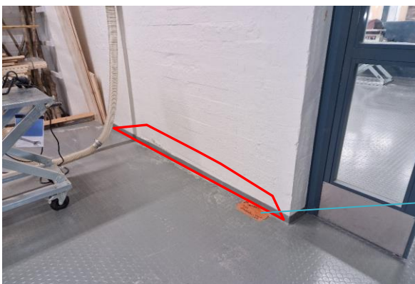
Kuva 121 Konesalin B056 ja materiaalivaraston B059 välisen seinän alaosassa esiintyy poikkeavaa kosteutta.
