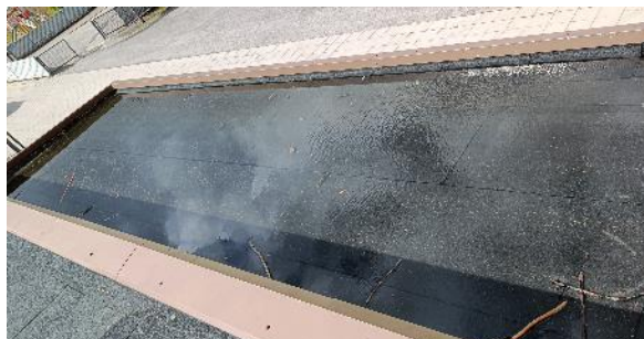
Kuva 160 Sisäpihan puoleisten sisäänkäyntien katosten vedenpoisto on tukkeutunut.
