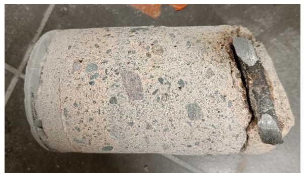
Kuva 21 Rakenteessa ei ole lämmöneristettä.
