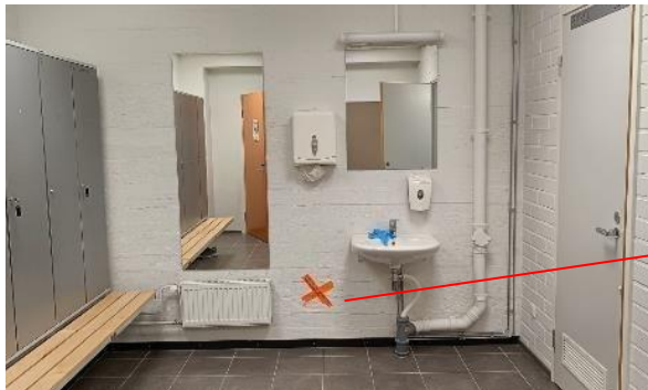
Kuva 17 Yleiskuva sosiaalitylilasta B017. Seinän alaosaassa esiintyy poikkeavaa kosteutta ja.
