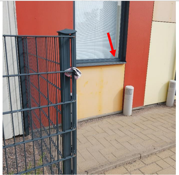
Kuva 37. Paikoin ikkunoiden vesipeltien kaadoissa havaittiin vähäisiä kallistuspuutteita.
