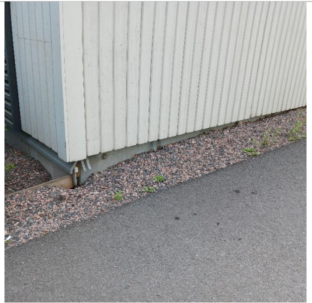
Kuva 25. Rakennuksen sisäpihan ja länsipään puolelta puuttuu suunnitelmista poiketen kosteutta kestävä sokkelilevy. Alapohjan kantava teräspalkki on vierustan maata vasten. Lautaverhoilun alaosa on lähellä maanpintaa.
