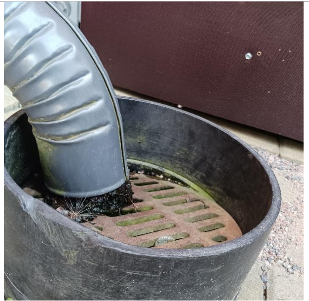
Kuva 49. Sisäpihalla syöksytorven ulosheittäjän havaittiin olevan tukossa.
