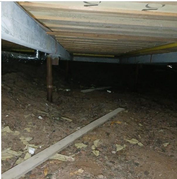
Kuva 10. Ryömintätilan pohjalla havaittiin paikoin rakennusjätettä, kuten lautoja ja mineraalivillaa.
