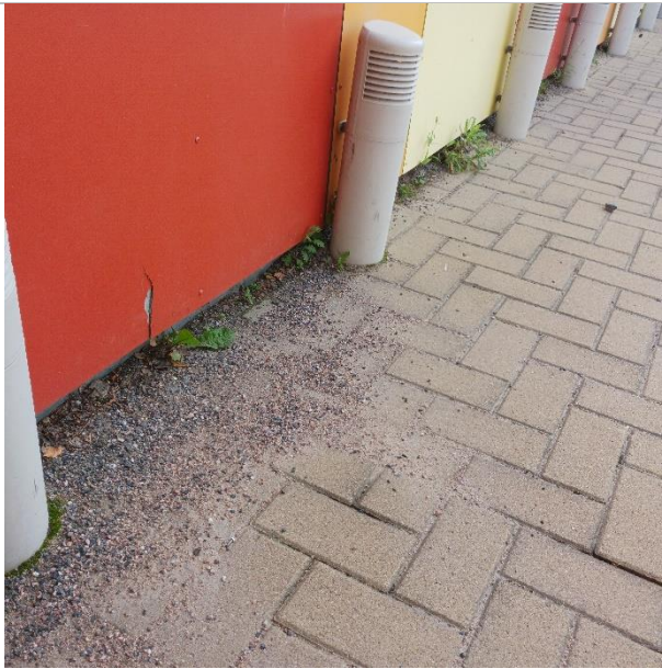
Kuva 24. Julkisivulevytyksen alareunassa havaittiin paikallisia vaurioita.
