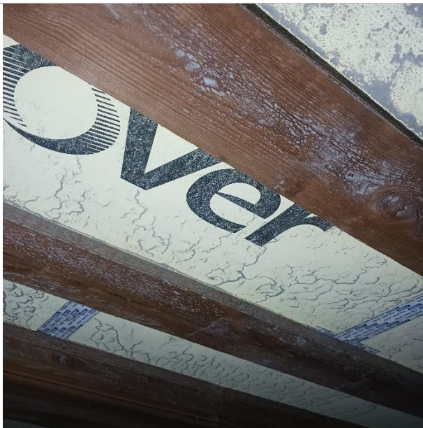
Kuva 17. Alapohjan lämmöneristekerroksen ulkopinnassa on rakennusaikaisia kosteuden aiheuttamia jälkiä.
