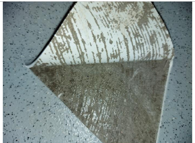
Kuva 21. VM4. Muovimatto on heikosti kiinni alustassaan. Muuten ei havaittu poikkeavaa.
