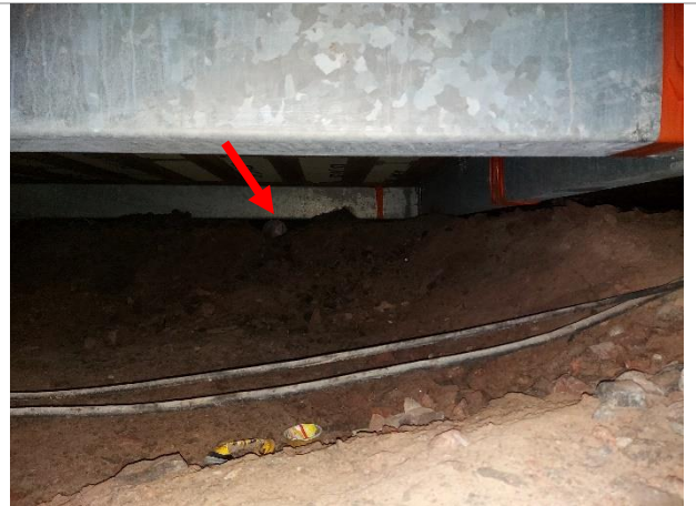
Kuva 13. Sisäpihan puoleisella ryömintätilan osalla ryömintätilan korkeus on suunnitelmista poiketen selvästi alle 800 mm. Nuolella merkattu tuuletusputken sijainti. Ryömintätilan maa-aines on osin hienojakoista ja kosteaa.
