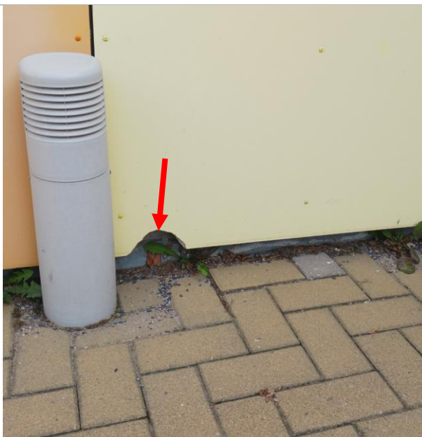
Kuva 26. Teräspalkin päällä olevissa puurakenteissa maanpinnan läheisyydessä havaittiin julkisivulevytyksen lohkeaman kohdalta tummentumaa.
