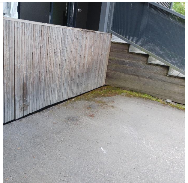
Kuva 27. Sisäänkäyntikatoksen sokkelilaudoituksessa havaittiin kosteusrasituksen aiheuttamia jälkiä.
