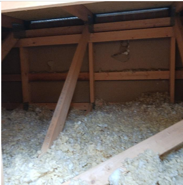
Kuva 46. Tuulensuojalevyssä havaittiin paikallisia mekaanisesti vaurioituneita kohtia.
