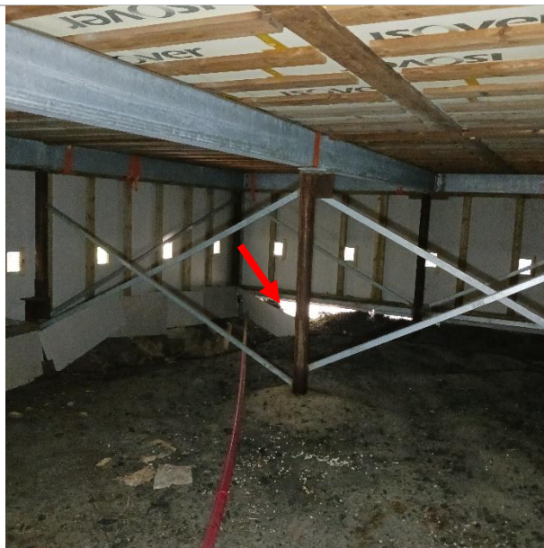
Kuva 14. Sokkelilevytyksessä havaittiin aukkoja.
