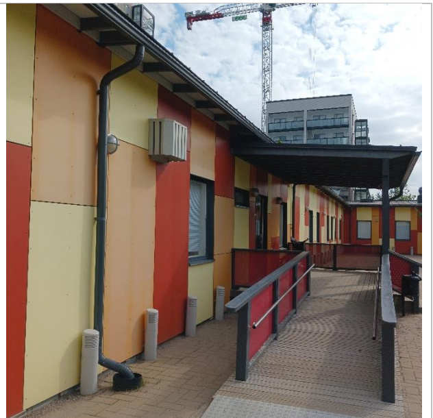
Kuva 23. Rakennuksen leikki-/sisäpihan puolen julkisivuna on levytys. Julkisivulevytyksen alareunan etäisyys vierustan maanpintaan nähden on vähäinen.
