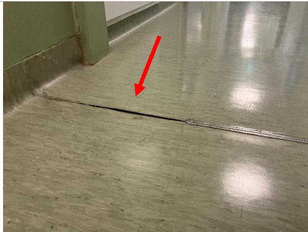
Kuva 6. Muovimaton saumoissa ja ylösnostoissa oli vähäisissä määrin havaittavissa epätiiveyttä, kuva on otettu tilan 042 edustalta.
