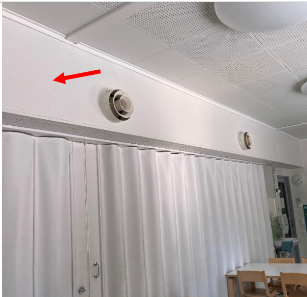
Kuva 30. Kipsilevyseinässä havaittiin vähäisiä pintavaurioita, kuten kipsilevysaumojen aukeamista. Merkattu kuvaan nuolella.
