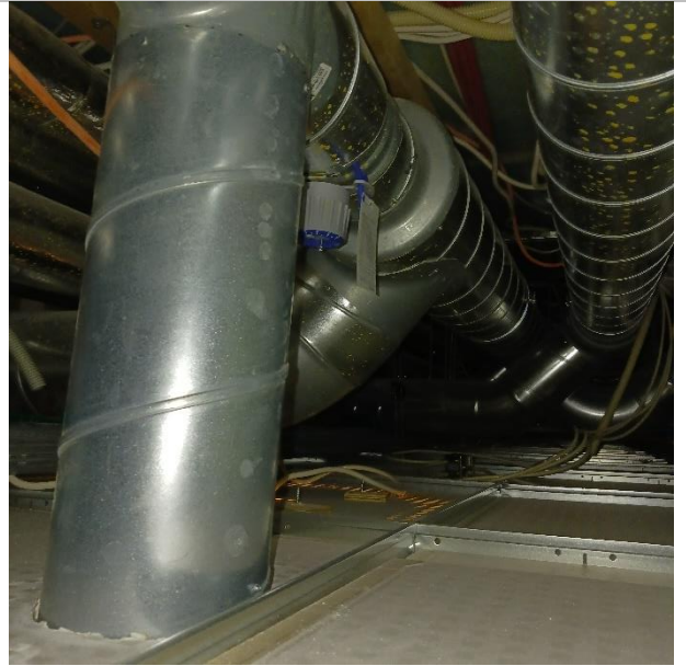
Kuva 41. Tilan 044 kohdalla käytävällä havaittiin alaslasketun katon yläpuolella ilmanvaihtokanavien ja lämmitysputkien eristeiden pinnalla kosteusjälkiä.
