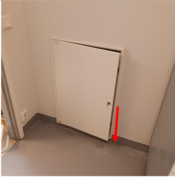
Kuva 8. Ilmavaihtokonehuoneessa 020 havaittiin kosteusjälkiä lattialla.
