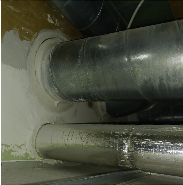
Kuva 40. Alaslasketun katon yläpuolella talotekniikan läpivientien väliseiniin havaittiin vähäistä epätiiveyttä. Kuva on käytävältä 031.
