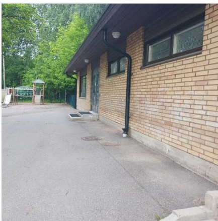
Kuva 78. Asfaltoidulla etupihalla maa viettää rakennuksesta pois päin.
