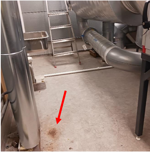
Kuva 49. Ilmanvaihtokonehuoneen muovimatto. Muovimaton pinnassa on vähäisiä valumajälkiä ja likaa.
