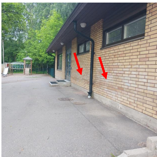
Kuva 27. Entisten istutusaltaiden kohdilla tiilimuurauksessa on tummentumaa noin 600 mm korkeudessa maanpinnasta.
