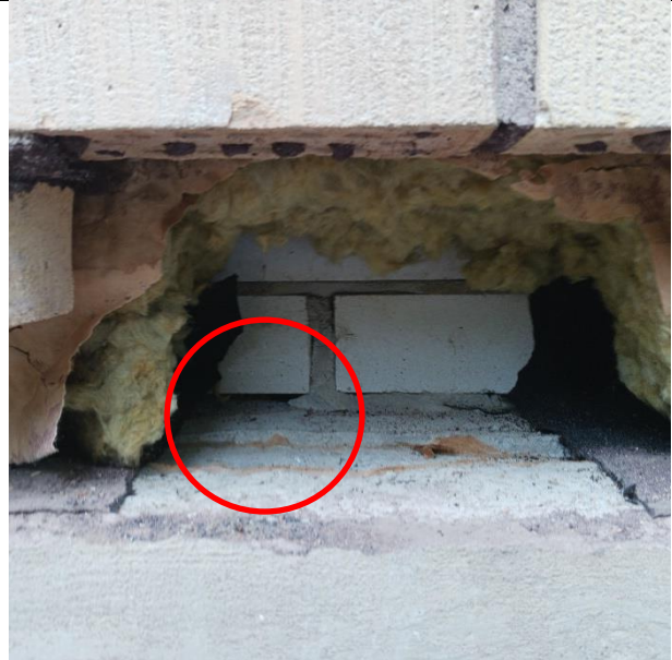
Kuva 2. Lähikuva rakenneavauksesta. Bitumikermi-kaista on nostettu ylös kantavan kahi-tiilimuurauksen pinnalle. Kahi-tiilimuurauksen laastisaumassa epä-tiiveyttä.
