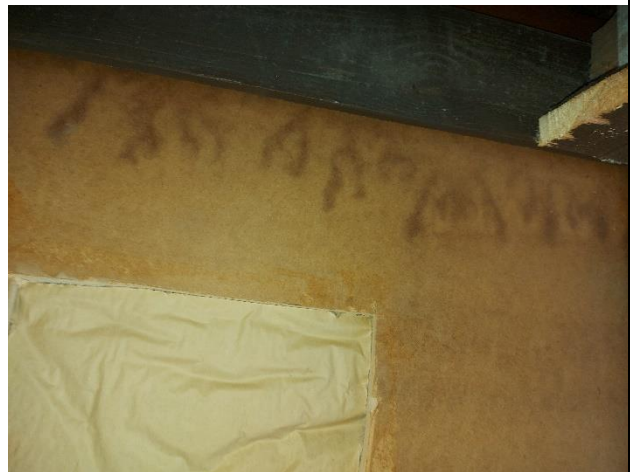
Kuva 2. Rakenneavauksen kohdalla puukuitulevyssä oli kosteusrasitukseen viittaavaa jälkeä.
