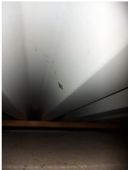
Kuva 3. Lähikuva vesikatteen alapuolisesta tuuletusvälistä.
