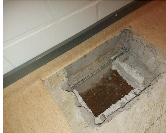
Kuva 14. RA22-AP/US. Alustäyttö on kapillaarista hiekkaa/moreenia, jonka havaittiin olevan kostea. Syvemmällä oleva perusmaa oli märkää.
