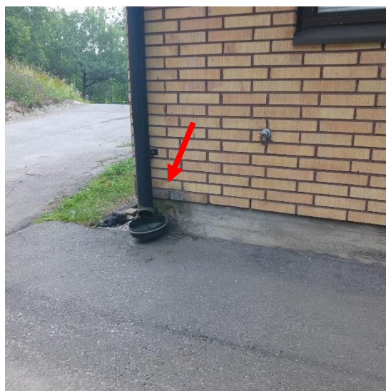
Kuva 31. Tiilimuurauksessa ja sokkelissa havaittiin kosteuden aiheuttamaa jälkeä syöksytörvien kohdilla.
