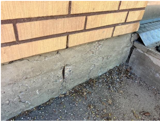
Kuva 28. Sokkelien ulkopinnassa on betonin pakkasrapautumisen ja teräskorroosion aiheuttamaa lohkeilua.
