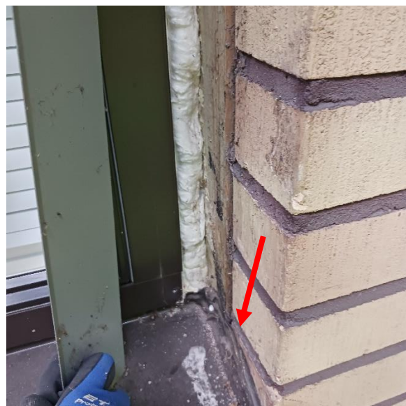
Kuva 47. RA20-Ikkunaväli. Ikkunapellityksen ylösnosto on tiivistetty massalla.
