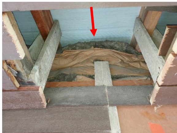
Kuva 68. RA5-YP. Mineraalivilla on tummentunut (rakennuspölyä, ulkoliman epäpuhtauksia nokea, siitepölyä yms).
