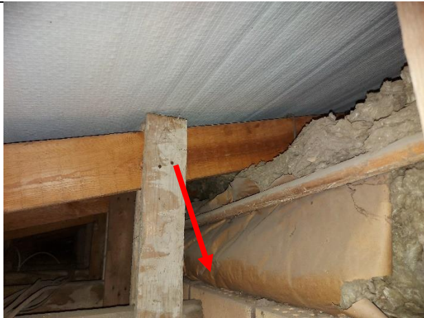
Kuva 1. Rakenneavaus tehtiin räystäs-/yläpohjarakenteeseen. Mineraalivilla tukkii julkisivutiiliverhouksen tuuletusvälin. Toisen kattokannattajan päältä puuttuu korotusrima.
