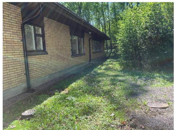
Kuva 79. Luoteissivulla on jyrkkä mäki, joka viettää rakennukseen päin. Rakennuksen vierusta ei kuitenkaan kallista rakennukseen päin.
