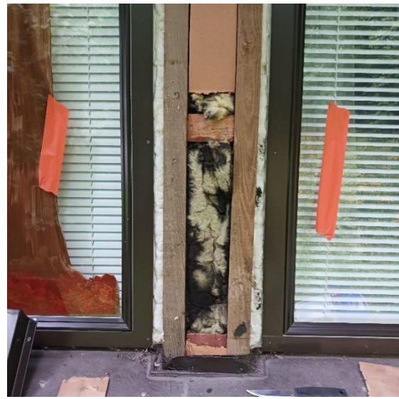
Kuva 2. Lähikuva rakenneavauksesta. Mineraalivillassa on tummentumaa.
