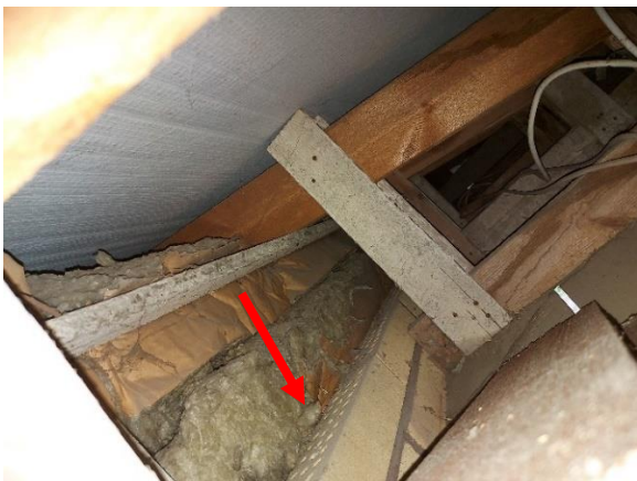
Kuva 69. RA10-YP. Rakenneavauksen kohdalla olevaa räystäsrakennetta. Mineraalivilla tukkii julkisivutiiliverhouksen tuuletusvälin.
