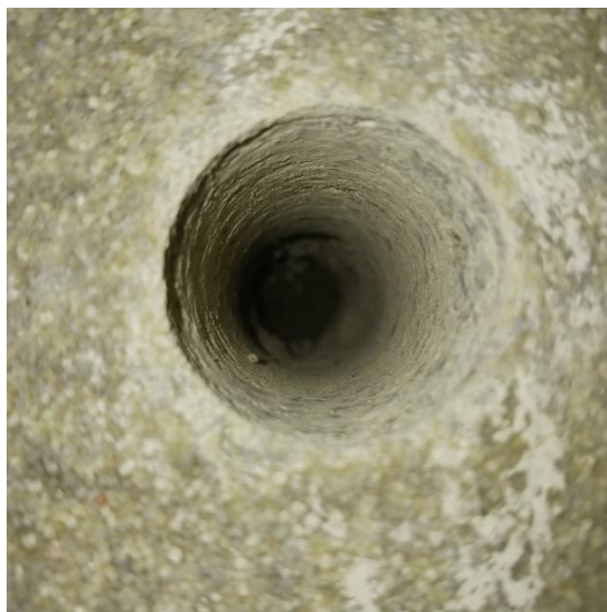
Kuva 12. RA15-AP. Lämmöneristekerroksen havaittiin olevan suunnitelmista poiketen 50 mm.
