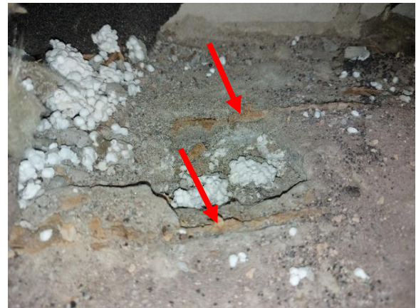
Kuva 34. RA3-US/SOK. Sokkelihalkaisun lämmöneristemateriaali on EPS, jonka molemmilla puolilla on puukuitulevy. Puukuitulevyssä havaittiin mikrobivaurioon viittaavaa jälkeä.
