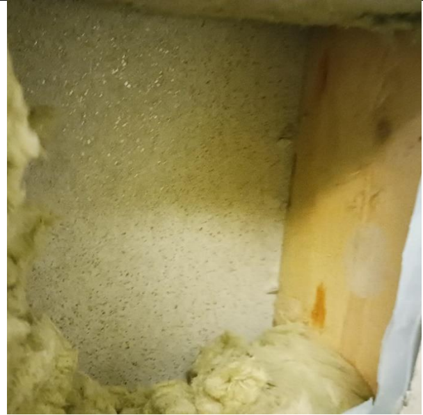
Kuva 2. Lähikuva rakenneavauksesta. Suunnitelmista poiketen ulkoseinärakenne on puurankarakenteinen ja kipsilevyverhoiltu.
