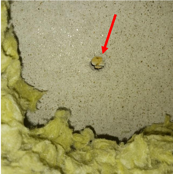
Kuva 41. RA14-US. Laajennusosan ulkoseinässä tuulensuojalevyn taustalla on julkisivulaudoitus eikä tuuletusväliä havaittu.
