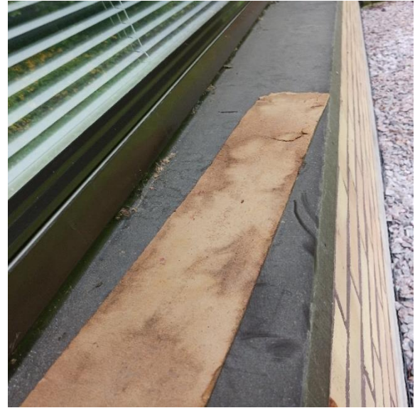
Kuva 38. RA9-Ikkunaväli. Puukuitulevyssä havaittiin kosteusjälkiä.
