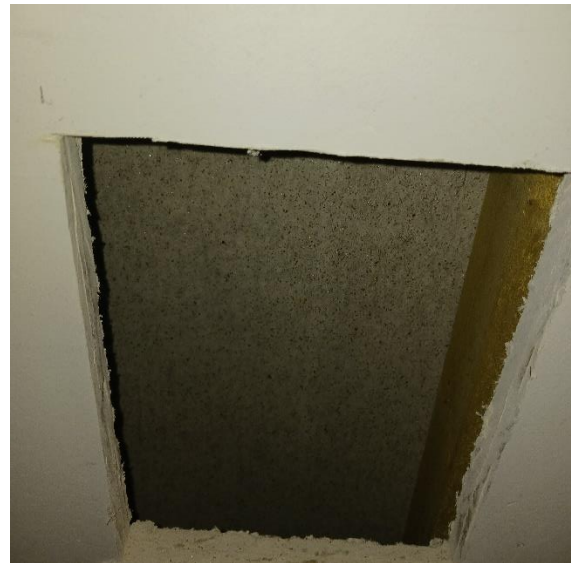
Kuva 4. Viereisen tilan nro. 15 (laatikkovarasto) ulkoseinässä ei ole mineraalivillaeristystä ja höyrynsulkua.
