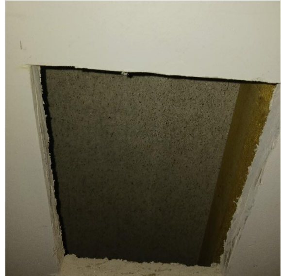
Kuva 42. RA14-US (Laudoitus). Laajennusosan laatikkovaraston ulkoseinässä ei ole mineraalivillaeristystä ja höyrynsulkua.
