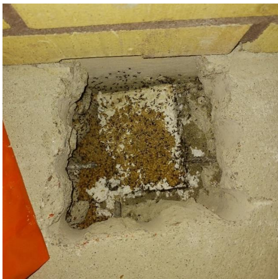
Kuva 11. RA23-AP/US. Lämmöneristekerroksen havaittiin olevan suunnitelmista poiketen 50 mm. Avauksen kohdalla havaittiin runsaasti muurahaisia.
