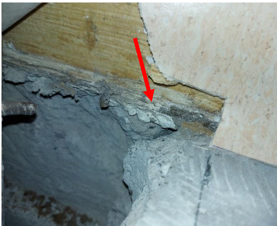
Kuva 15. RA25-AP/US. Alapohjalaatan liittymäkohta ulkoseinään on tiivistetty kittimassalla muovimaton ylösnoston alta (merkattu nuolella).
