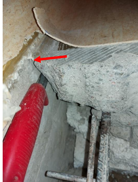
Kuva 4. Alapohjalaatan ja ulkoseinän/sokkelin liitoskohta on tiivistetty kittimassalla muovimaton ylösnoston alta. Betonilaatan ja väliseinän välissä on rako.
