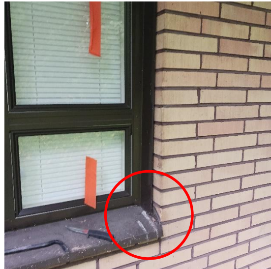
Kuva 32. Ikkunoiden vesipeltien ylösnostot on asennettu osin pielilistojen taakse. Liitoskohtaa on tiivistetty massalla.
