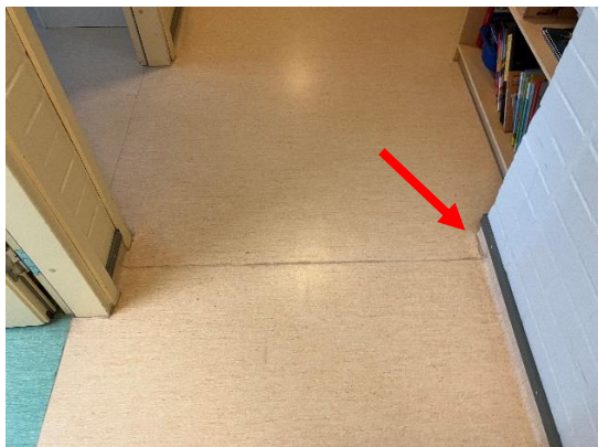
Kuva 9. Käytävän lattian liikuntasauaman kohdalla havaittiin halkeama muovimaton ylösnostossa.
