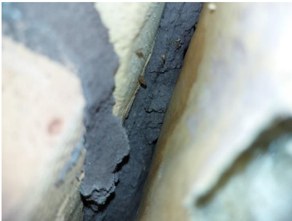
Kuva 33. RA3-US/SOK. Julkisivutiilimuurauksen taustan tuuletusväli niukka tai se on kokonaan ummessa. Kuva on otettu rakenneavauksesta ylöspäin.
