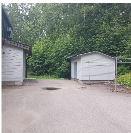
Kuva 82. Rakennuksen luoteissivulla on erillinen jätevarasto. Asfaltissa on painaumia, johon kerääntyy vettä.
