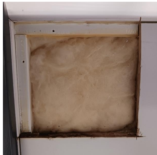
Kuva 2. Rakenneavauksessa ei havaittu vaurioita tai kosteuden osoittamia jälkiä.
