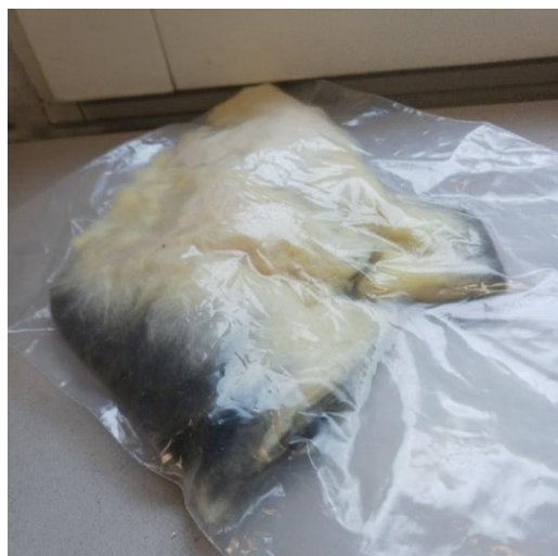
Kuva 4. Rakenteen lämmöneristeen ulkopinnassa havaittiin tummentumaa.
