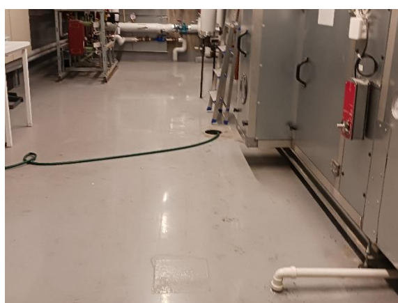
Kuva 54. Ilmanvaihtokonehuoneen lattia oli pinnoitettu.
