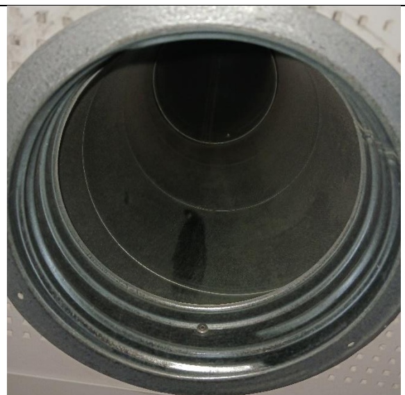
Kuva 65. Tilan 210 poistoilmakanavan pölynkertymä vastaa alle 0,4 g/m 2 .
