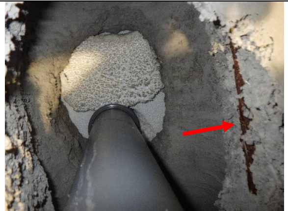
Kuva 17. Läpivientien kohdalla ontelolaatan jännepunoksia on paikoin paljaana ja niissä havaittiin ruostetta.
