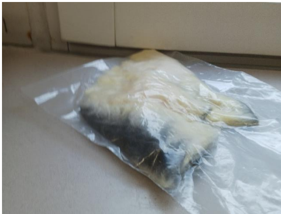
Kuva 49. Rakenneavauksen RA5-US4 lämmöneristekerroksessa havaittiin tummentumaa.
