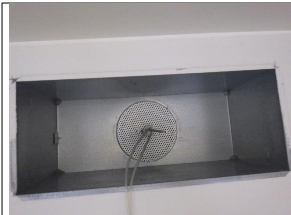
Kuva 60. Tuloilman päätelaite tilassa 213. Tuloilman kanavan puhtautta ei voinut tarkastaa päätelaitteen kautta. Tuloilmalaatikon pölynkertymä vastaa alle 0,4 g/m 2 .
