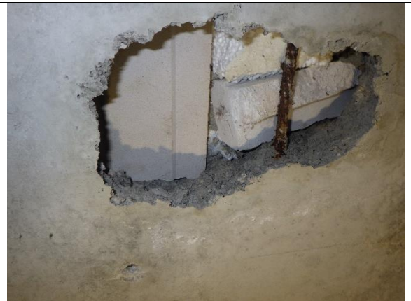
Kuva 19. Alapohjaontelolaatan ylimääräinen varaus, jota ei ole valettu umpeen.
