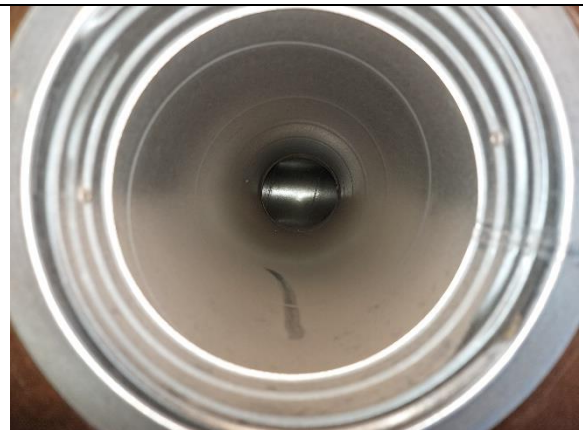
Kuva 63. Tilan L102 poistoilmakanavan pölynkertymä vastaa alle 0,7 g/m 2 .
