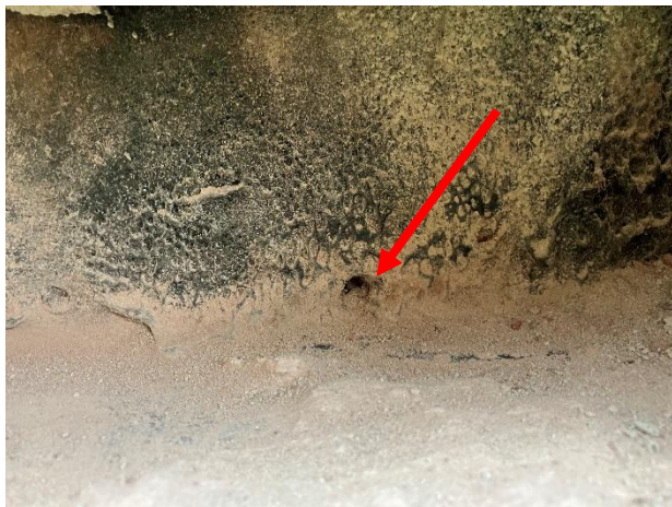
Kuva 3. Kumibitumikaistaleessa on pieni reikä.
