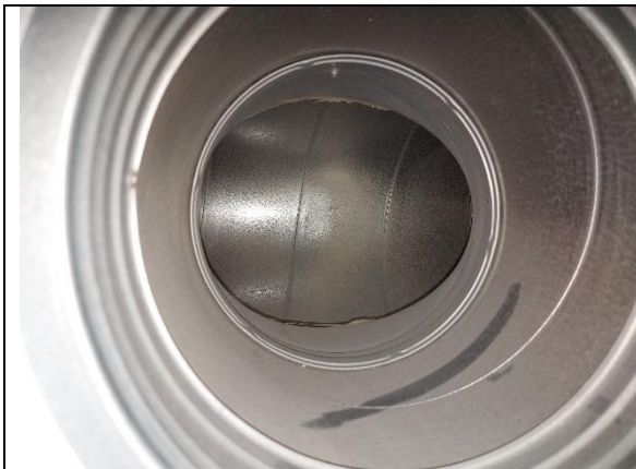
Kuva 62. Tilan L106 poistoilmakanavan pölynkertymä vastaa alle 0,4 g/m 2 .
