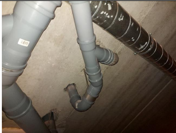
Kuva 16. Alapohjaontelolaattojen läpivientejä on avoinna onteloihin ja lämmöneristekerrokseen.
