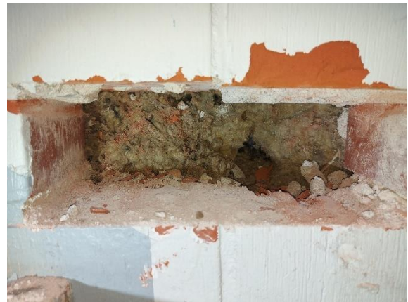
Kuva 48. RA10-US. Rakenneavauksen sisällä havaittiin rakennusjätettä.
