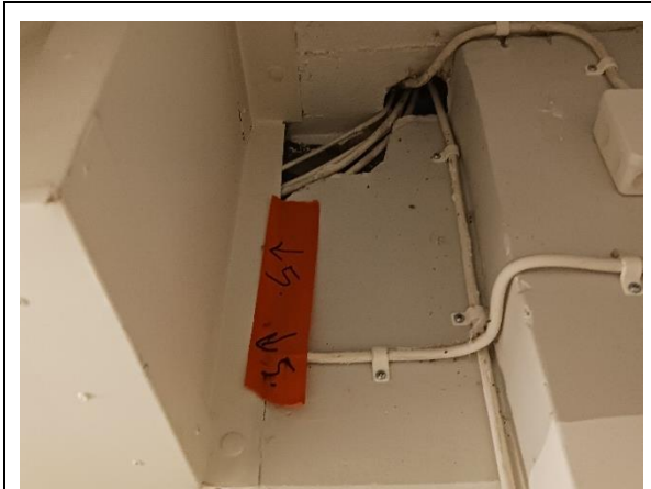
Kuva 38. Maanvastaisessa seinässä havaittiin avonaisia läpivientejä.
