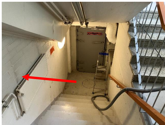
Kuva 36. Porrashuoneen K66 maanvastaiseseinärakenteessa havaittiin paikallisia kosteuden aiheuttamia vaurioita.
