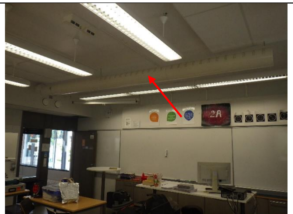
Kuva 61. Tuloilman suutinkanava tilassa L106. Kanavan puhtautta ei voinut tarkastaa päätelaitteen kautta.
