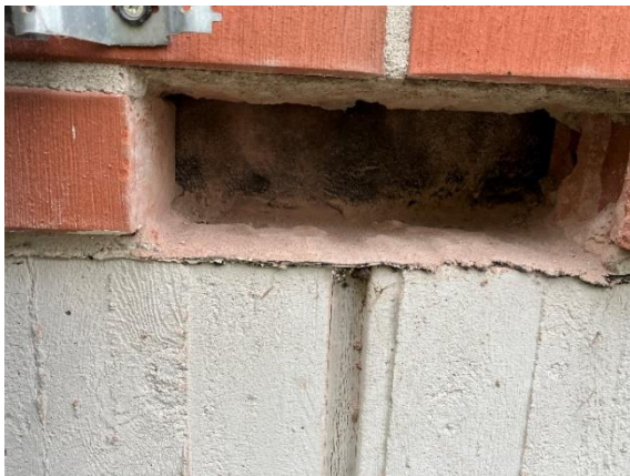
Kuva 51. Rakenneavauksen RA12-US5 Havaittiin sokkelielementin ja tiilimuurauksen välinen kermikaista on nostettu tuulensuojakipsilevyä vasten.
