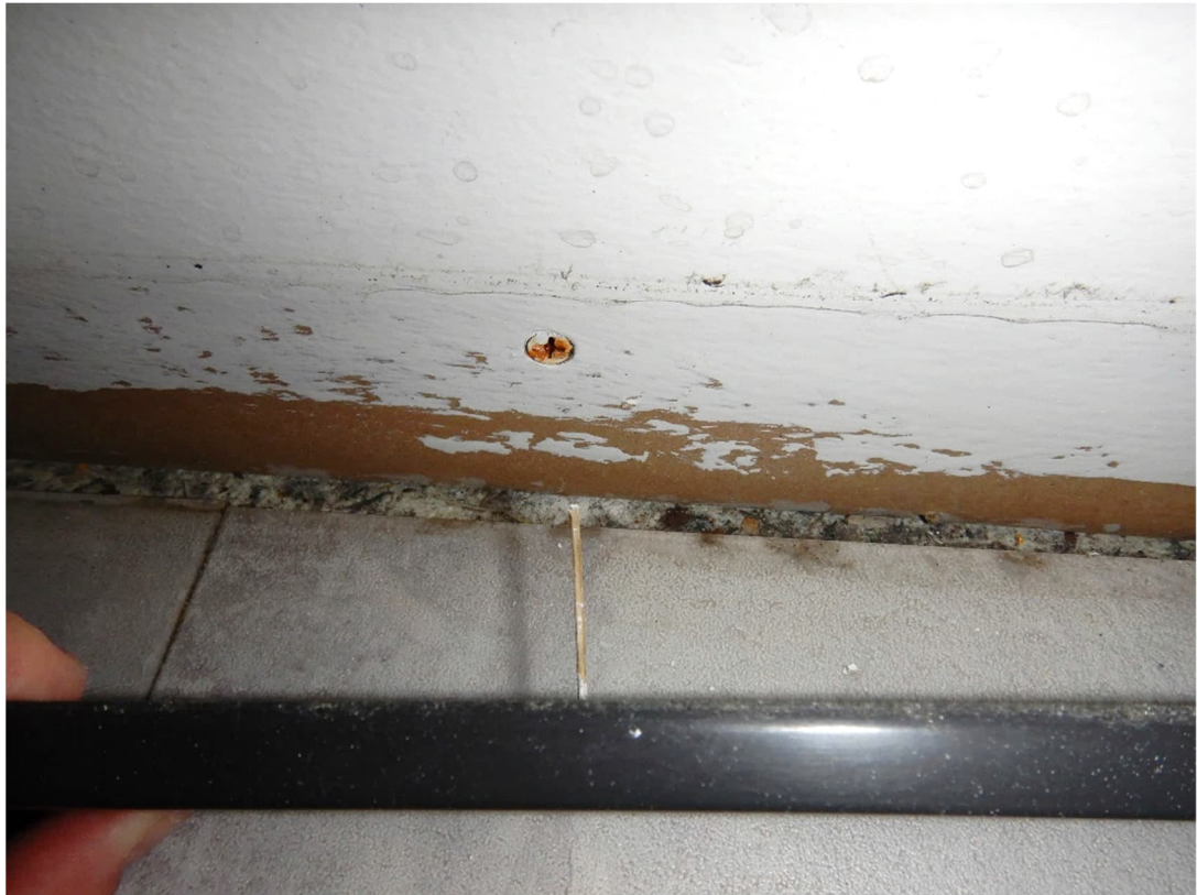
Kuva 15. Alapohja-ulkoseinäliittymien tiivistyskaistat on havaintojen mukaan rei'itetty asentamalla jalkalistat nauloin ja ruuvaamalla sisäpinnan levytys alareunasta runkopuuhun. Lattialiittymien ilmatiiveyttä on tarkasteltu luvussa 8.4, jossa käsitellään ulkoseiniä.
