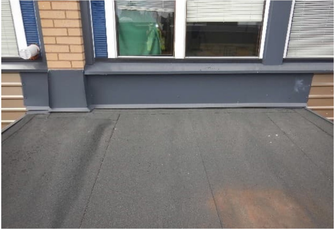
Kuva 88. Yhdyskäytävien osalla bitumikermi kupruili, mutta oli havaintojen mukaan ehjä. Pohjoissivun katoksen kaadot ovat melko loivat ja kermin pinnalla on lammikoitumisen jälkiä.
