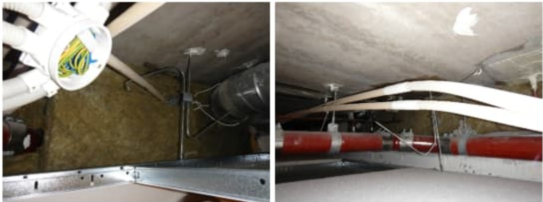
Kuva 75 a-b. Tilan 1088A ja 1088 välisen väliseinän yläosassa on väliseinän ja välipohjan välillä avoimet mineraalivillalevyt.
