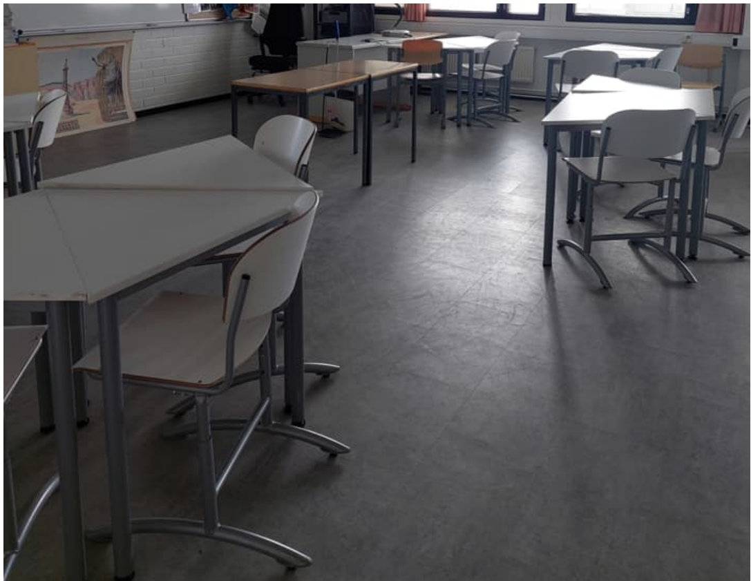
Kuva 24. Sisäilmakorjauksissa uusitut joustovinyylilaatat ovat ikäänsä nähden jo paikoin hyvin kuluneita.
