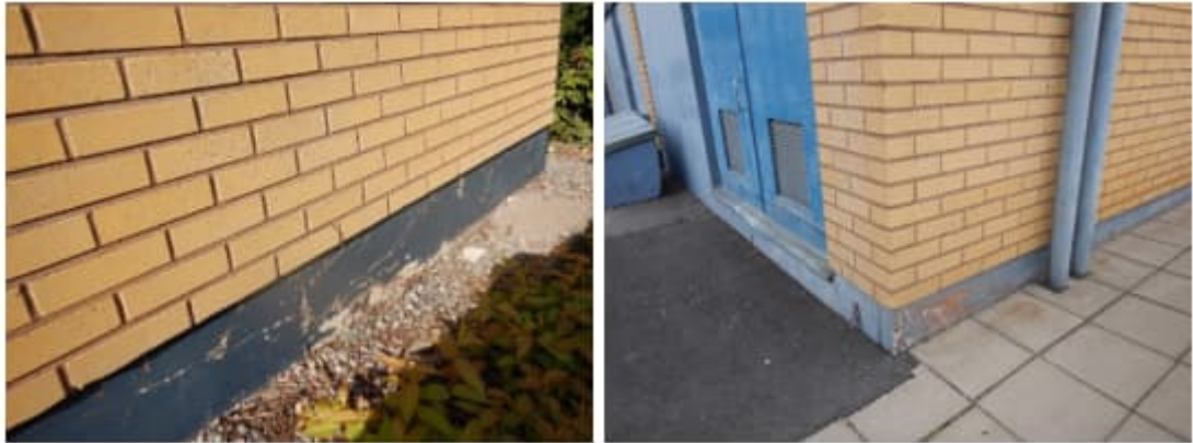
Kuva 37. a-b. Sokkelipinnassa havaittiin kulumaa ympäri rakennusta, sekä paikallisesti korroosiovaurioita sokkelin betoniteräksissä.
