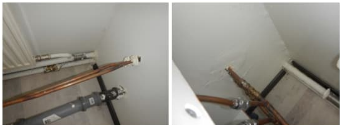
Kuva 73 a-b. Väliseinien putkiläpivientejä on tiivistetty elastisella massalla kipsilevyä vasten. Massauksissa havaittiin paikoin tiiveyspuutteita.
