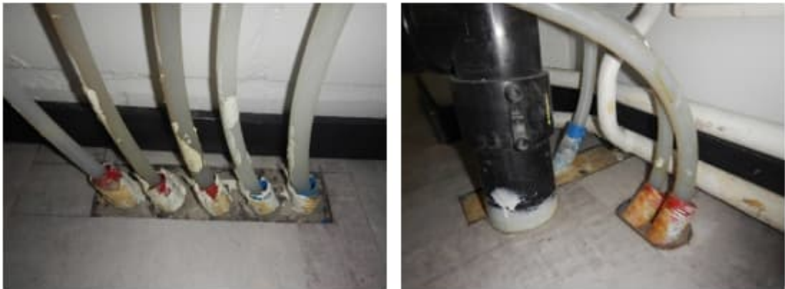
Kuva 14. a-b. Tiivistyskorjatuissa tiloissa alapohjien läpivientien tiivistyksissä havaittiin puutteita ja suojaputken sisäosa on tiivistämättä.
