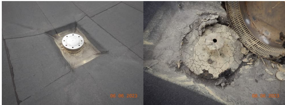
Kuva 93 a-b. C-osan vesikatolla tukkeutunut kattokaivo. Vesi on lammikoitunut ja poistunut pienemmän roskasihdin päällä olevan reiän kautta.
