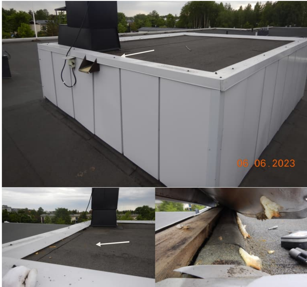
Kuva 90. a-c. Hissikuilun katolta on yksi ulosheittäjä. Kermin ylösnosto reunoilla on hyvin matala (arviolta 5 cm) eikä kermi ulotu seinälinjan ulkopuolelle. Rakenteessa on kastumisriski veden padottuessa ulosheittäjän kohdalle.
