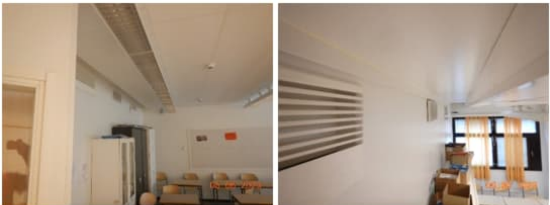
Kuva 100 a-b. Yleiskuvat luokista 2047 ja 2014. Useassa luokkahuoneessa on alaslaskettu katto sekä tuloilmapäätelaitteisiin nähden poikittain olevat valaisimet. Tuloilmasuihku osuu alakaton otsapintaan ja valaisimiin, jolloin tuloilman huuhteluvaikutus tilassa heikkenee. Tilojen takaosiin jää katvealueita.
