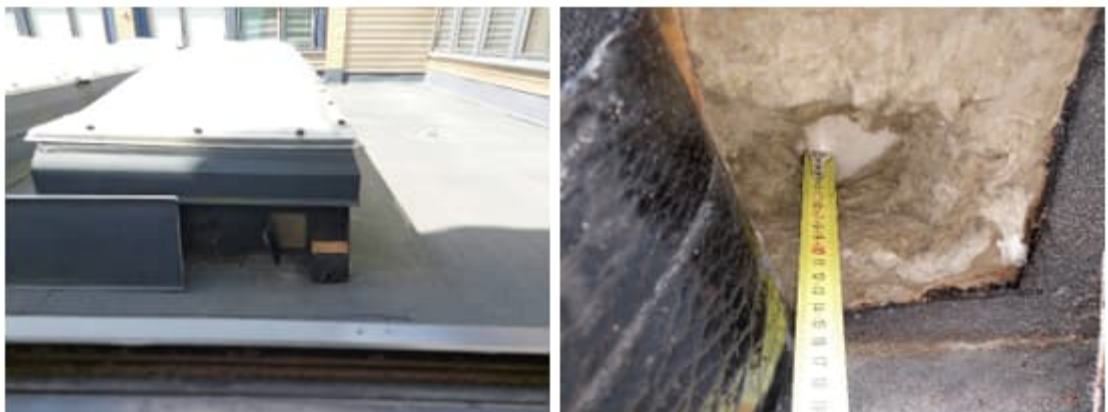
Kuva 95. a-b. Kattoikkunan rakenteet tarkastettiin rakenneavauksella RA11 sisäpuolella havaitun vesivuotojälkien kohdalta. Mineraalivillasta otettiin materiaalinäyte mikrobianalyysiin MN11.
