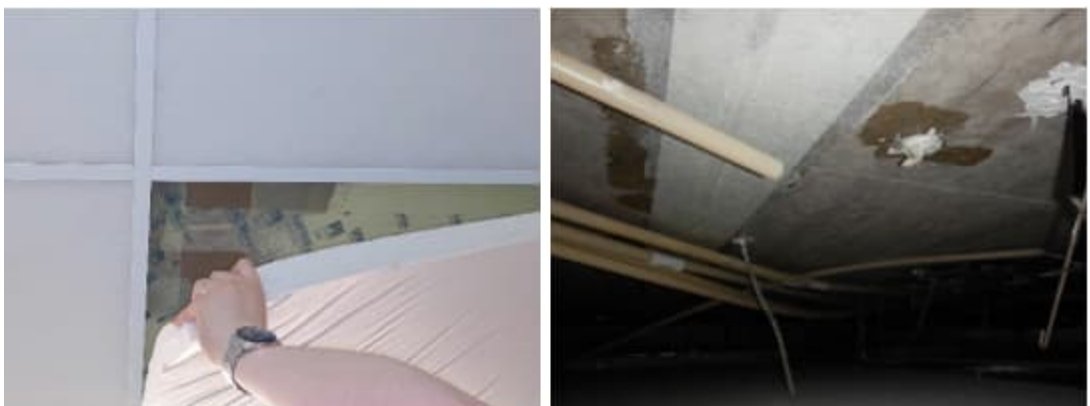
Kuva 27. a-b. Tiivistyskorjattujen tilojen välipohjien kattopinnoissa on Dacron akustiikkalevyt. Akustiikkalevyjen takaa välipohjan alapintojen
