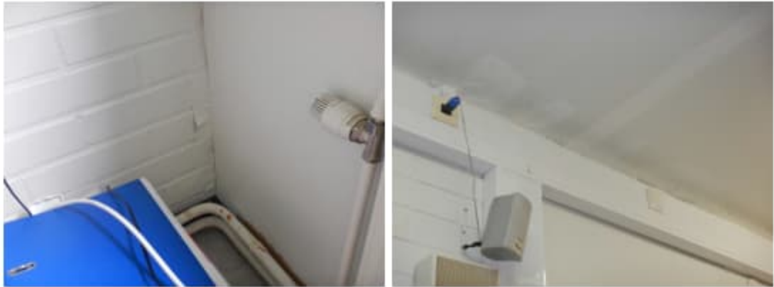
Kuva 74 a-b. Väliseinäliittymiin tehdyissä tiivistyskaistoissa havaittiin tiivistyskaistojen repeämistä/rakoilua ainakin tiloissa 1099, 1100 ja 1103 sekä 2002 ja 2006 ja 2011.
