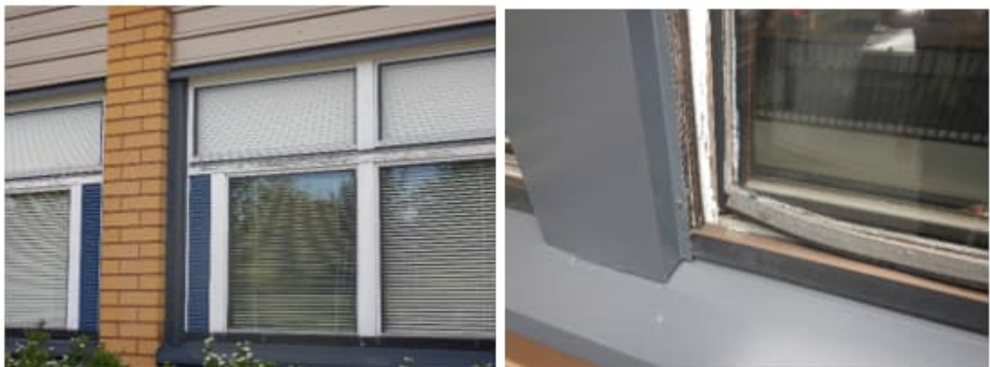
Kuva 39. a-b. Ikkunoiden puiset ulkopuitteet olivat paikoin kuluneita ja vaurioituneita. Myös puitteiden yläpuolisen pellin maalipinnat hilseilivät.
