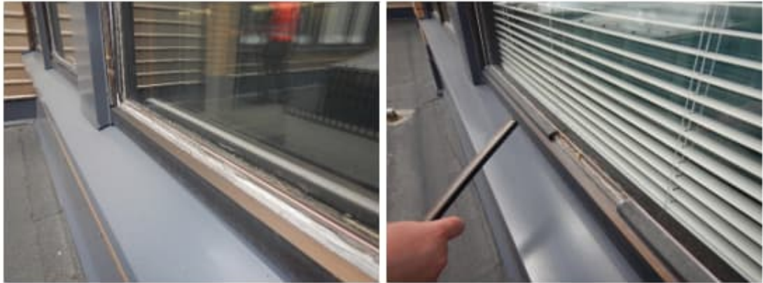
Kuva 40. a-b. Tilojen 2045–2046, 2021–2022, 2036 ja 2038 sekä käytävän 2001 ikkunoiden ulkopuutteet ja kittaukset olivat huonokuntoiset ja vaurioituneet tai kokonaan irronneet. Ulkopuolen lasituksia on useita, jotka ovat osittain irti.
