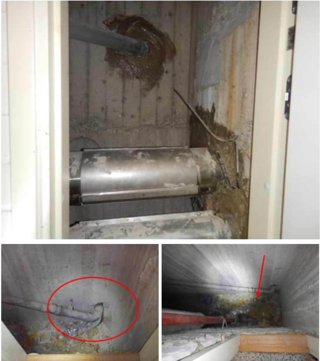
Kuva 21. a-c. Porraskäytävien takaosassa olevat tekniikkakuilut ovat aistinvaraisesti tunkkaiset ja alaosistaan täynnä rakennusjätettä ja mineraalivillaa. Betonin lävistäviä läpivientejä on tiivistetty osittain TKR-pinnoitteella, mutta tiivistämättömiä läpivientejä havaittiin yhä.
