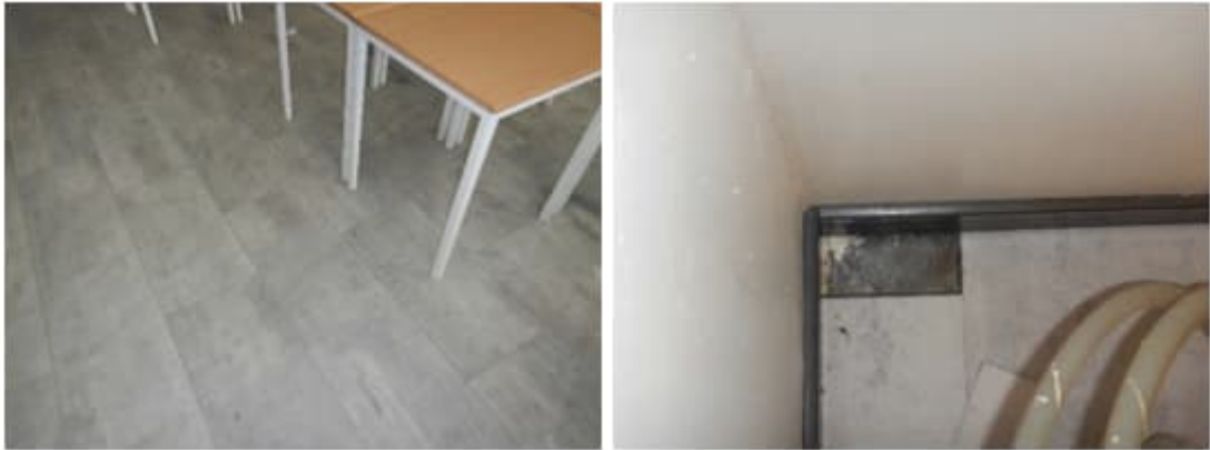
Kuva 13. a-b. Tiivistyskorjattujen tilojen alapohjien betonipinta on käsitelty lähtötietojen mukaan TKR-pinnoitteella tai Ardex EP2000 -epoksilla. Joustovinyylilaatat ovat paikoin erittäin kuluneita ikäänsä nähden.
