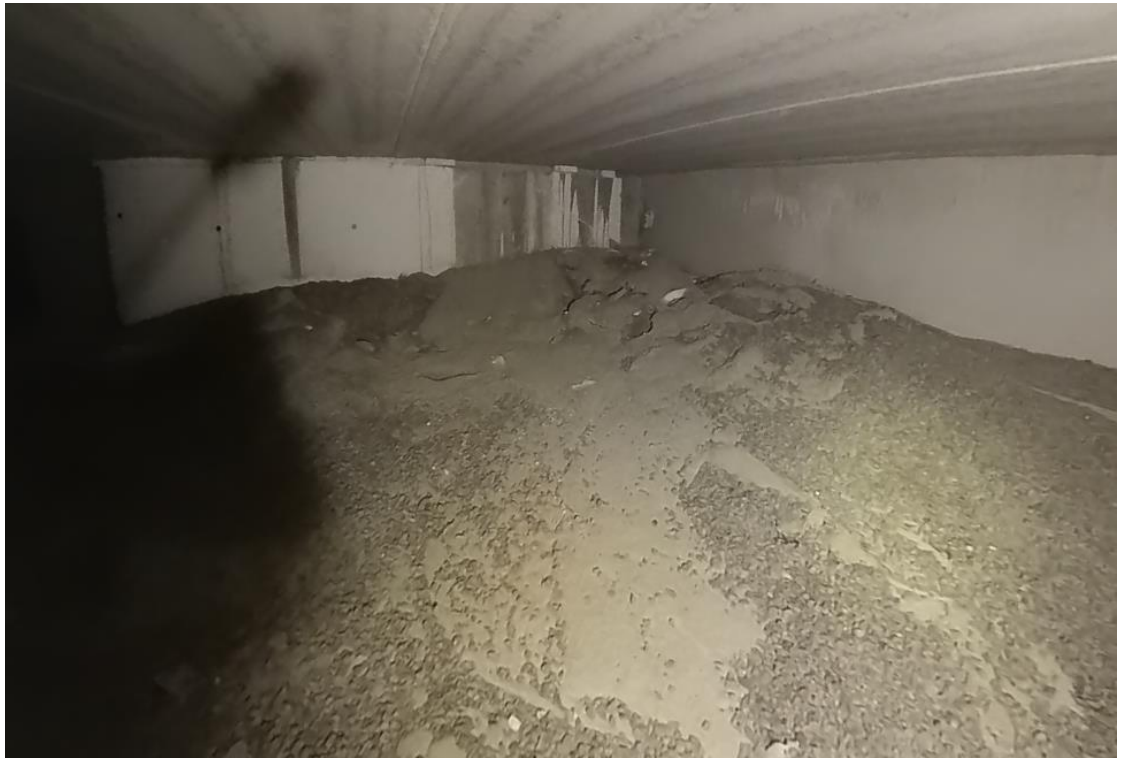
Kuva 12. Paikallisesti oli yhdessä kohtaa sepelikerroksen päällä betonijuotosmassaa.
