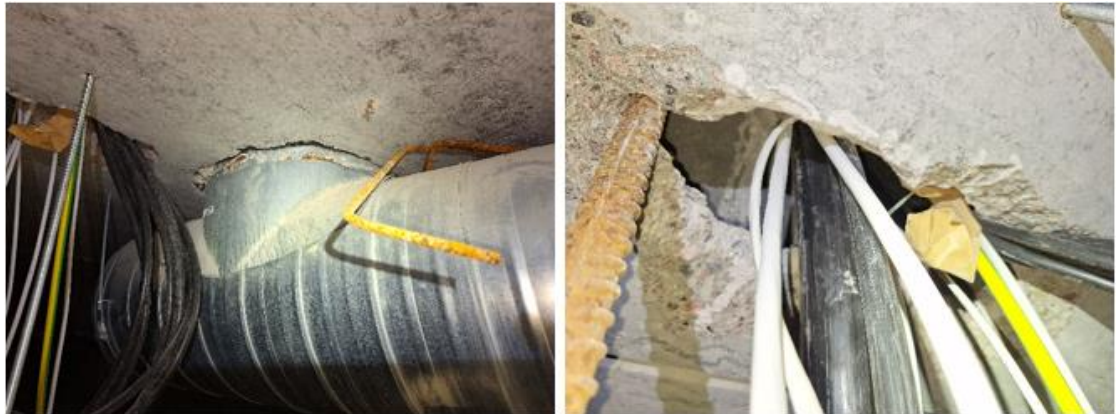
Kuva 7 a-b. Iv-kanavan sekä sen vieressä olevien sähköjohtojen läpiviennit ontelolaatastoon ovat epätiivitä.
