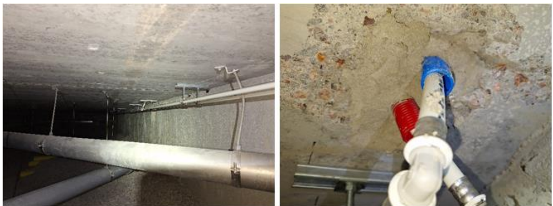
Kuva 6 a-b. Käyttövesiputkien läpiviennit suojaputkeen ovat epätiiviit.
