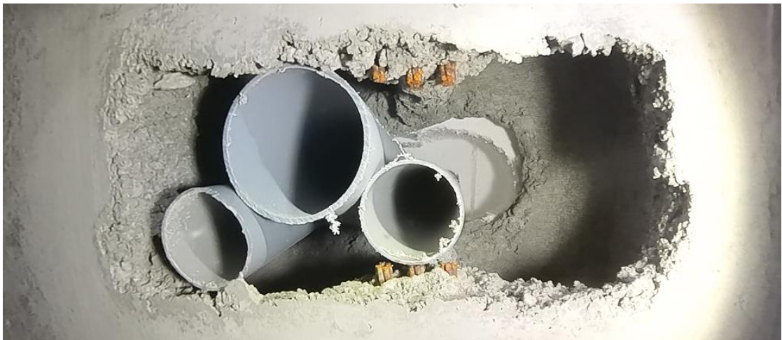
Kuva 8. Alapohjan läpivienneissä oli havaittavissa ilmatiiveyspuutteita ja rakenteellisia puutteita. Kuvassa on nähtävillä alapohjan putkiläpivientejä sekä alapohjan eristekerroksia.
