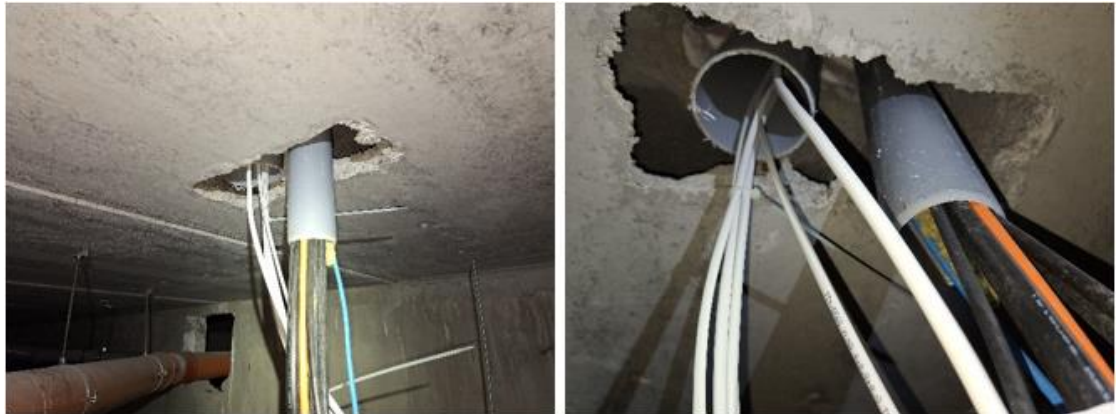
Kuva 9 a-b. Sähköläpivienneissä on ilmatiiveyspuutteita.
