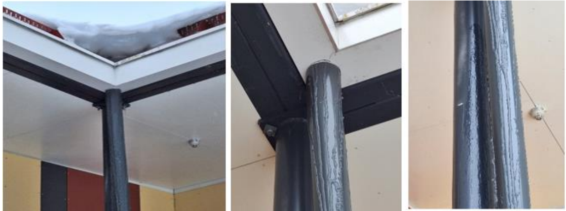
Kuva 22 a-c. Rakennuksen sisäpihalla on jäätä tukkeutunut sade- ja sulamisvesien syöksytorvi. Vettä valuu ja suunnittelemattomasti syöksytorven ja pilarin ulkopinnalla.
