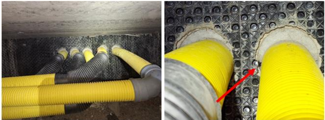
Kuva 10 a-b. Koulun kellarikäytävälle johtavia putkiläpivientejä on tiivistetty valulla. Paikoin valussa on kuitenkin nähtävillä rakoja ja kohtia, joihin massaa ei ole kertynyt.
