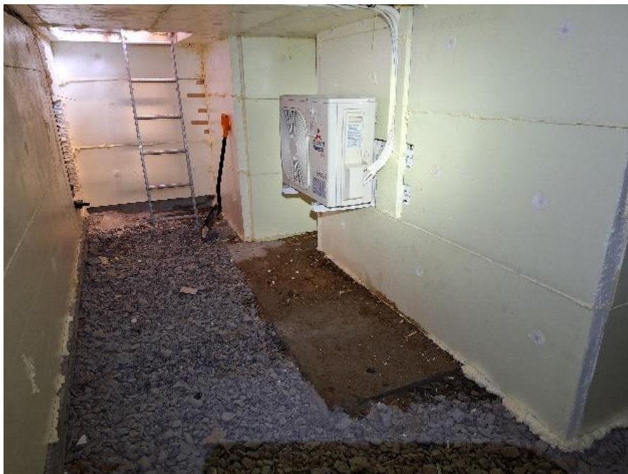
Kuva 18. Ulkoasenteisen ilmanjäähdyttimen ulkoyksikön alle kertyy kondenssivettä.
