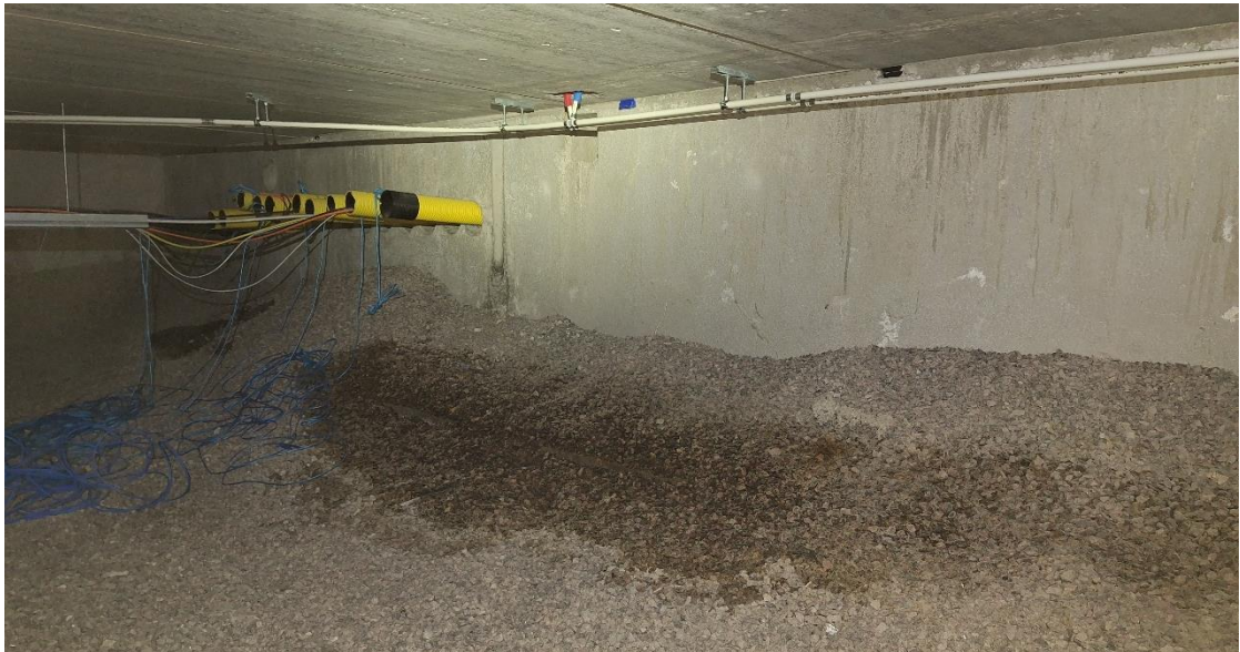
Kuva 4. Paikallinen kostea kohta sepelikerroksessa. Sepelin alla on anturavalu, joka oli aistivaraisten havaintojen mukaan myös tummalta sepelin alueelta kostea.
