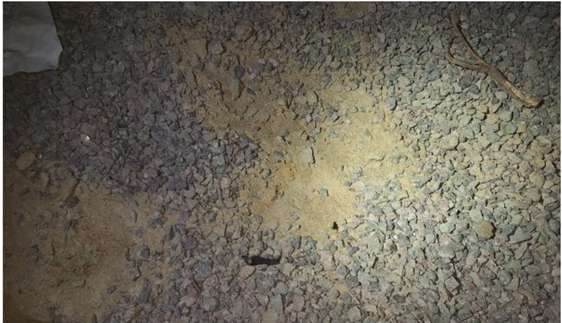
Kuva 3. Paikoin todettiin melko vähäisen sepelikerroksen alla todella hienoa hiekkaa. Hiekka oli kuitenkin kuivaa.
