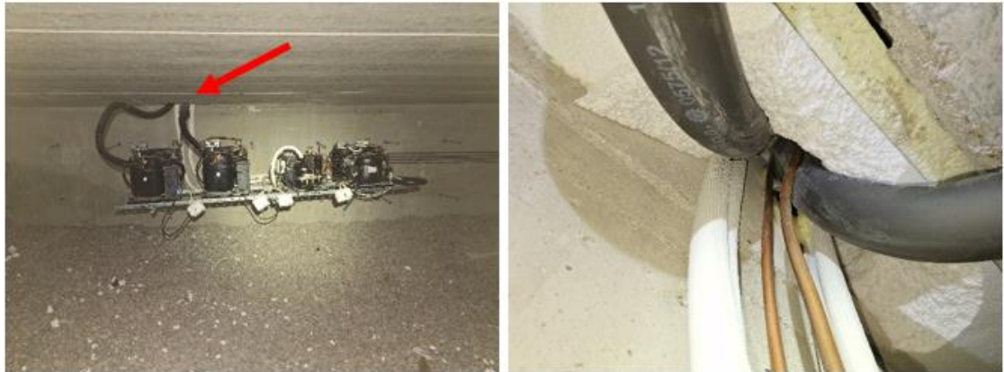
Kuva 11 a-b. Kompressoriyksiköiden läpiviennit yläpuolisiin rakenteisiin ovat epätiivitä.
