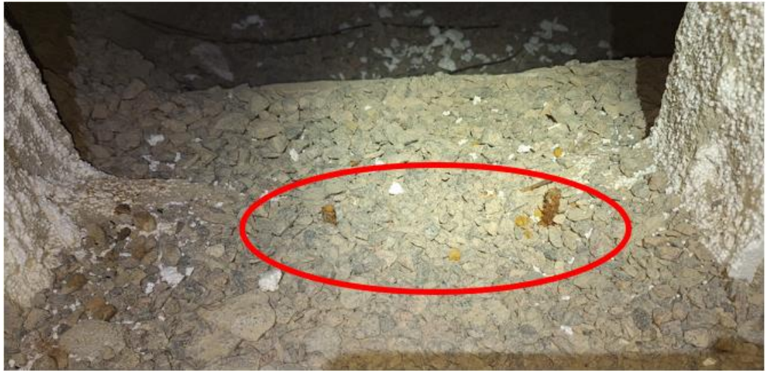
Kuva 5. Käyntiaukkojen kohdalla oli paikoin harjaterästappeja tai pikanauloja.
