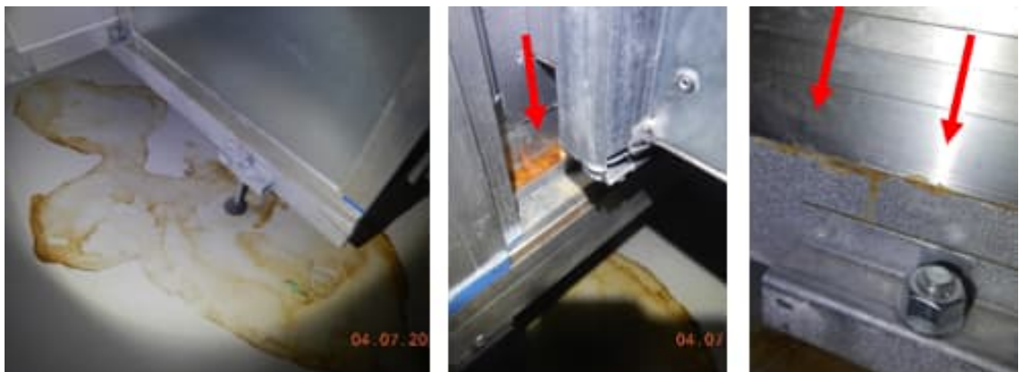
Kuva 74. Ilmanvaihtolaitteiston alla oli tummahko vuotojälki. Kosteutta ei tutkimushetkellä havaittu. Vuotojäljen kohdalla on ruostejälkiä ilmanvaihtokammion rakenteissa.
