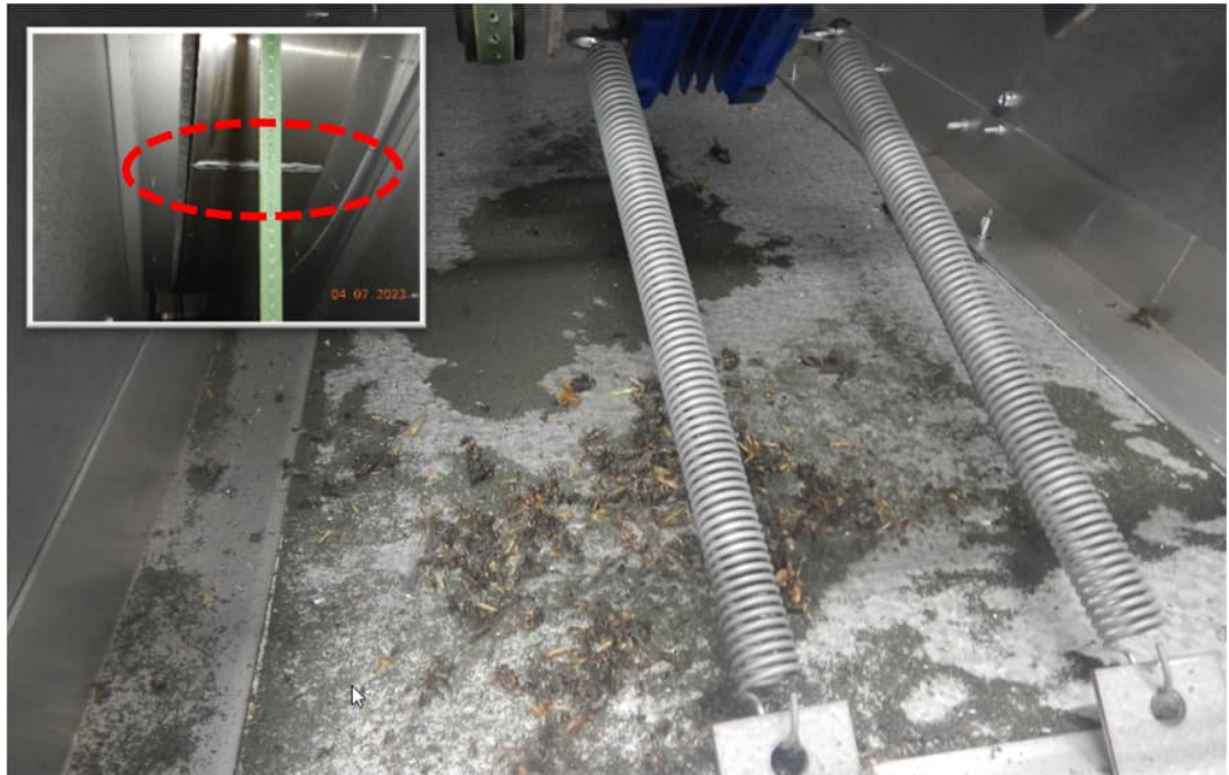
Kuva 73. Tuloilman pyörivän lämmönsiirtimen hihna on osin kulunut ja siitä on irronnut materiaalia lämmönsiirtokammion pohjalle. Lämmönsiirrin on koottu paikan päällä hitsaten. Hitsaussaumojia ei ole hiottu, jolloin ne kuluttavat hihnaa. Lisäksi kammion pohjalla on havaittavissa paljon kuolleita hyönteisiä.
