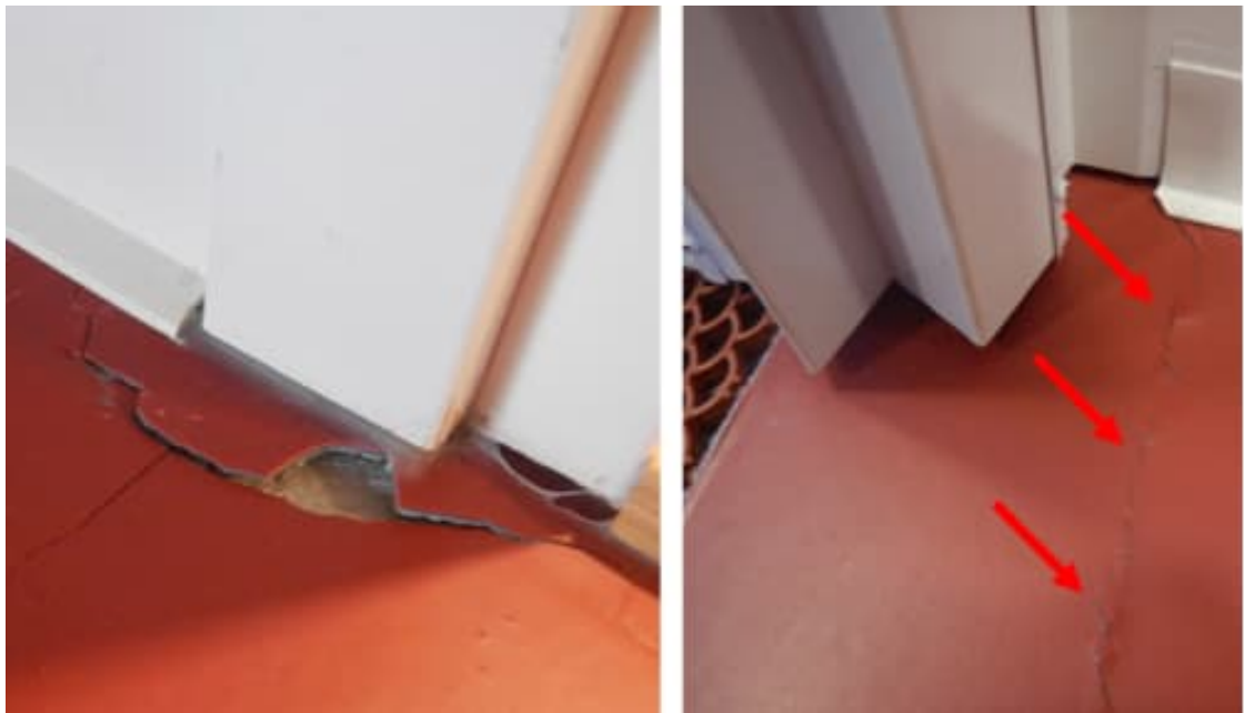
Kuva 38. Lattiapinnoitteessa havaittiin paikallisia puutteita. Pinnoite on irronnut alustastaan ovenkarmin rakenneliittymien ympäriltä. Lisäksi pinnoitteessa havaittiin paikoitellen halkeamia. Halkeamien sijainnit on kuvattu liitteenä olevissa pohjakuvissa.
