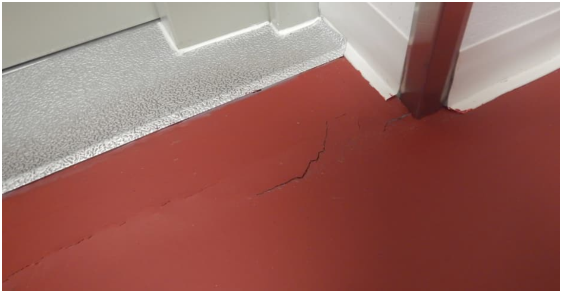
Kuva 18. Tilassa 121 ala-aula / yhteistila on lattian massapinnoite halkeillut hissien edustalta. Pinnoite vaikutti olevan osin irti alustastaan.
