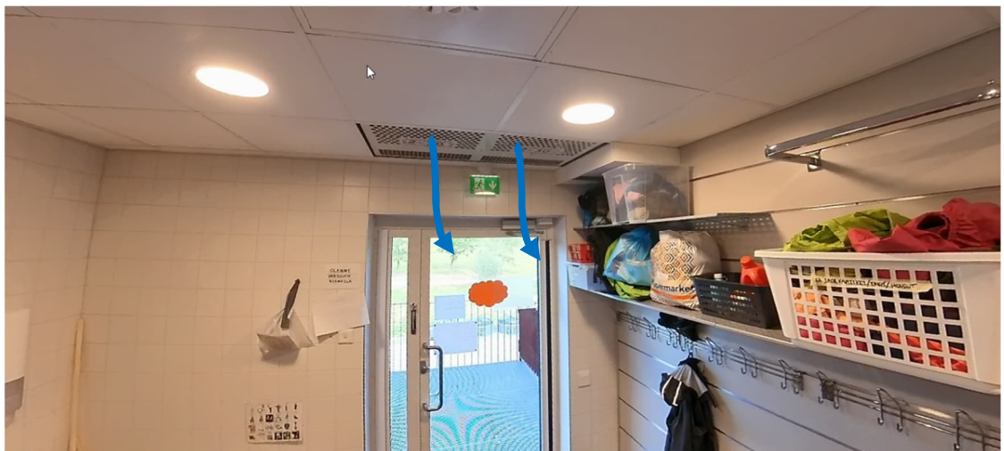
Kuva 42. Tilan 132 vuotohavainto sijoittui käyttäjän mukaan eteisessä olevan puhallinkonvektorin kohdalle.
