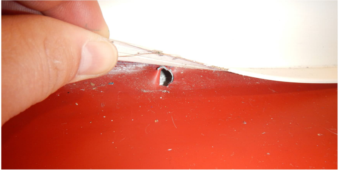
Kuva 39. Tilan 208 eteinen käytävällä havaittiin pinnoitteen nousseen irti lattiasta seinän vierellä. Havaintojen perusteella vaikuttaa siltä, että pinnoite on nostettu ainakin osittain väliseinäpinnoille.
