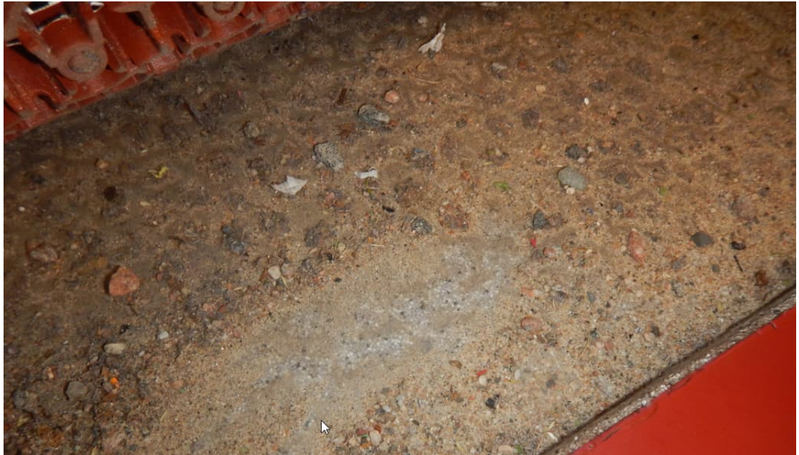
Kuva 23. Märkäeteisten kumiritilämaton alla on todella paljon hiekkaa ja likaa. Akryylibetonipinta on miltei kokonaisuudessaan hiekan ja lian peitossa.
