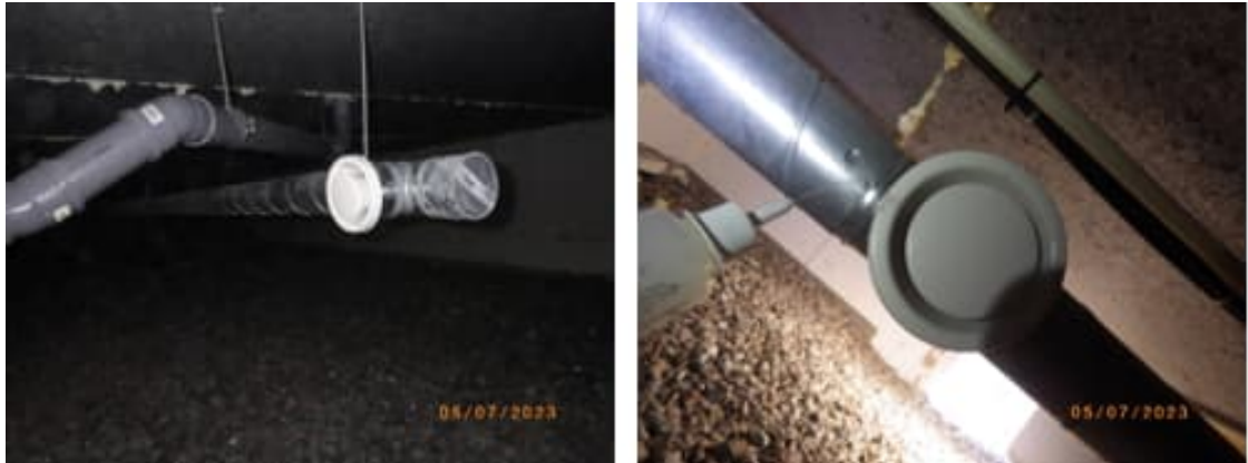
Kuva 11. Alapohjassa kulkee suunnitelmien mukainen poistoilmakanavisto, jonka toimivuutta tarkasteltiin merkkisavulla.
