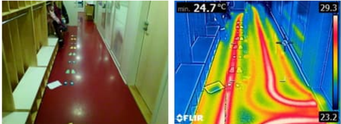
Kuva 70. 2. kerroksen eteiskäytävät koetaan lämmityskausina ajoittain kuumiksi. Kuvassa käytävä/eteinen 227. Viereisten tilojen lattialämmityspiirit kulkevat käytävän kautta.
