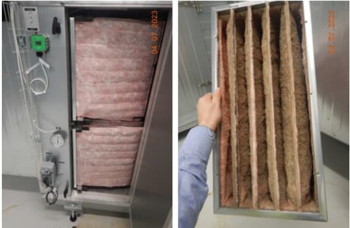
Kuva 71. Tuloilmasuodattimien asennuskiskot olivat kuitenkin paikoin auki ja tuloilmasuodattimet olivat likaiset.
