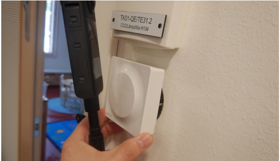
Kuva 66. Huonetilojen sisäilman olosuhteita hallitaan automatiikalla, ja ainakin yksittäinen säätölaite on huonosti kiinni. Automatiikka reagoi huonetilojen lämpötilaan sekä hiilidioksidipitoisuuteen.
