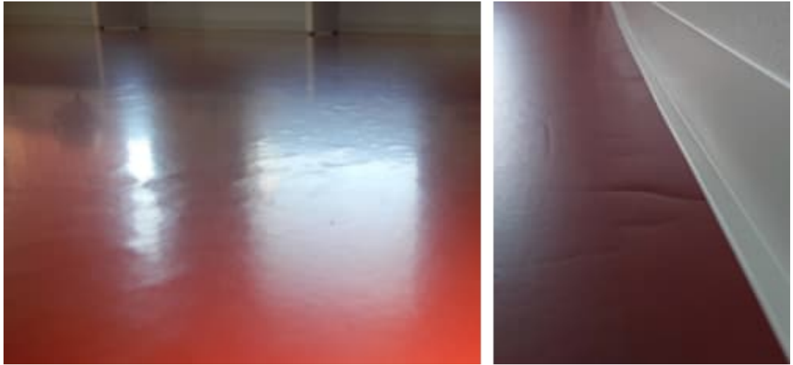
Kuva 37. Välipohjien massapinnoitteessa on havaittavissa paikoin aaltoilua ja pinnan verkottumista, osin halkeilua. Paikallisesti pinnoite oli irti alustastaan.
