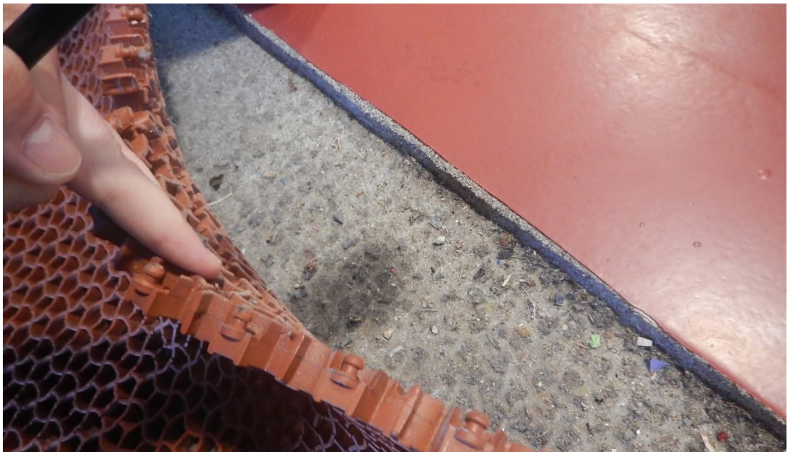
Kuva 40. Märkäeteisten kumiritilämaton alla, on todella paljon hiekkaa ja likaa. Akryylibetonipinta on miltei kokonaisuudessaan lian peitossa.
