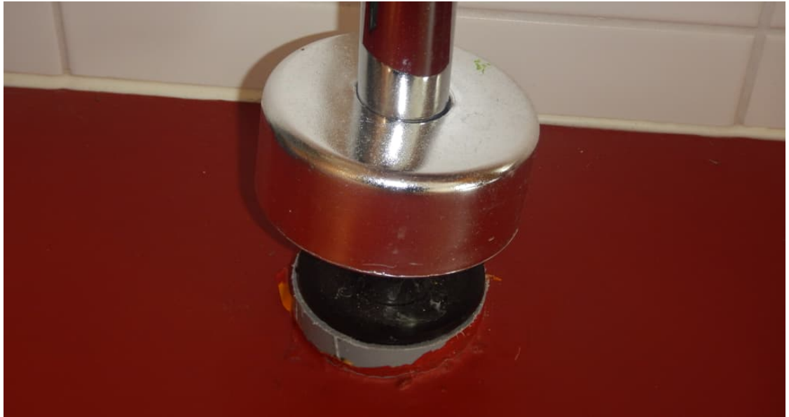
Kuva 19. Lattiapinnoitteen ja läpivientien rakenneliittymät vaikuttivat massalattioiden osalta tiiviiltä.
