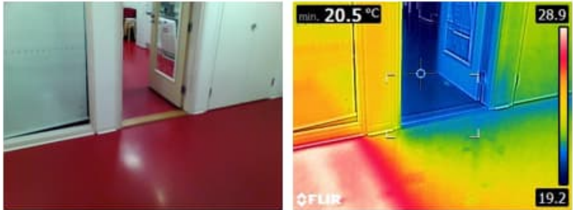
Kuva 17. Tilassa 123 kotikeittiö huomattiin, että jakotukilta ei tule vielä lämmintä vettä lattialämmityspiiriin.
