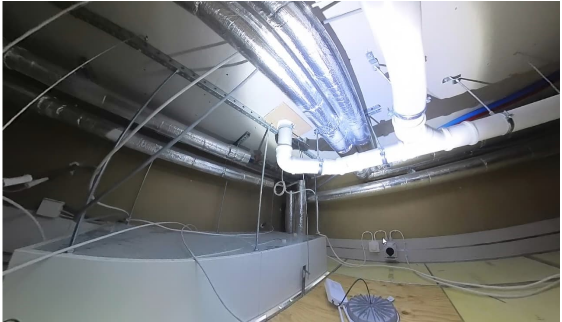
Kuva 41. Lähtötietojen mukaan märkäeteiseen 132 on tullut vettä välipohjasta. Tilan 132 alaslaskutila tutkittiin, eikä rakenteista havaittu jälkiä vuotovedestä.
