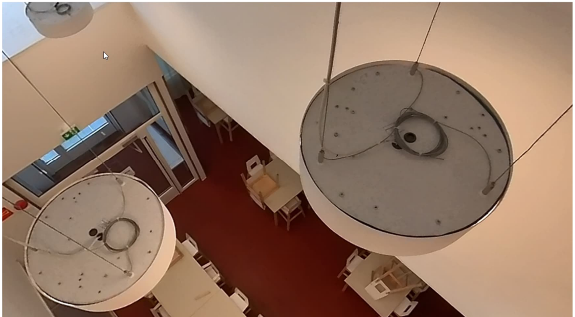
Kuva 65. Valaisinten päällä havaittiin tutkimusten aikana paljon pölyä usean tilan kohdalla. Kuvassa olevat valaisimet roikkuvat korkealla ja niiden tasopintoja on hankala puhdistaa.
