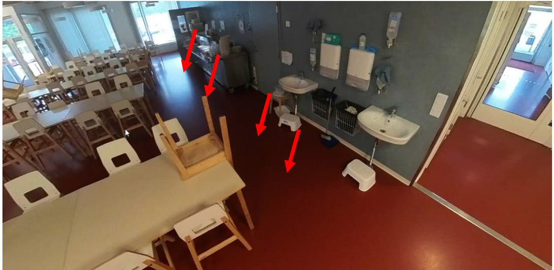
Kuva 24. Tilassa 117 ruokailutila oli havaittavissa lattiapinnoitteessa painauma. Lattiapinnoite ei ole rikkoutunut täältä alueelta. Pintakosteuden vertailuarvot olivat muuhun lattiapintaan nähden koholla. Painuman kohdalla vertailuarvot olivat noin 90 kun muualla saman tilan alueella ne olivat 70-80.
