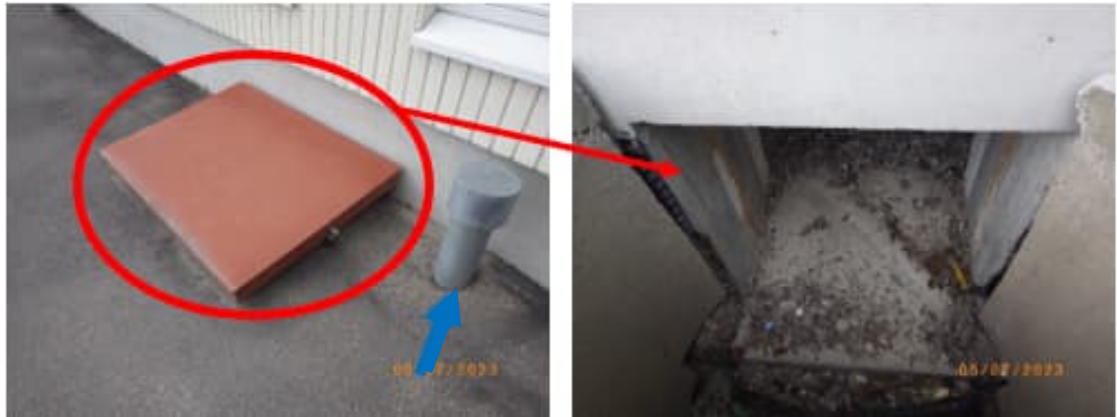
Kuva 7. Käynti alapohjaan tapahtuu rakennuksen koillispuolelta kahden luukun kautta. Luukkua avatessa kulkuaukon eristelevy oli pois paikoiltaan. Korvausilman tuuletuspaalu merkitty sinisellä nuolella.
