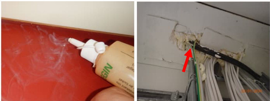
Kuva 26. Tilan 107 varasto sähkökaapin oven alta havaittiin ilmavirtauksia huonetilaan. Alapohjan läpiviennit ja rakenneliittymät todettiin merkkisavun avulla tiiviiksi. Vuotoa havaittiin katossa olevista välipohjan kaapeliläpivienneistä (kohta merkitty punaisella nuolella).
