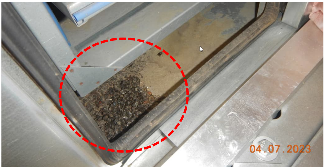
Kuva 72. Tuloilmakanavan pohjalla on melko paljon kuolleita hyönteisiä ennen tuloilmasuodattimia.
