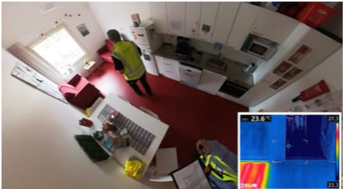
Kuva 16. Tilassa 123 kotikeittiö on myös siistikuntoinen massalattia. Tutkimusten aikana huomattiin lämpökameralla, ettei lattialämmityksen jakotukilta tullut ollenkaan lämmintä vettä tämän tilan lattialämmityspiiriin.
