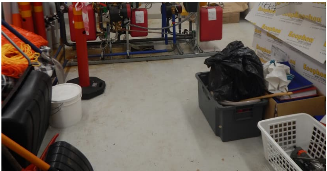
Kuva 25. Teknisen tilan 101 lattiapinnalla pintakosteuden vertailuarvojen olivat kauttaaltaan koholla muiden tilojen vertailuarvoihin verrattuna. Vertailuarvojen lukema vaihteli 85-100 välillä. Poikkeavaa hajua ei tilassa havaittu.
