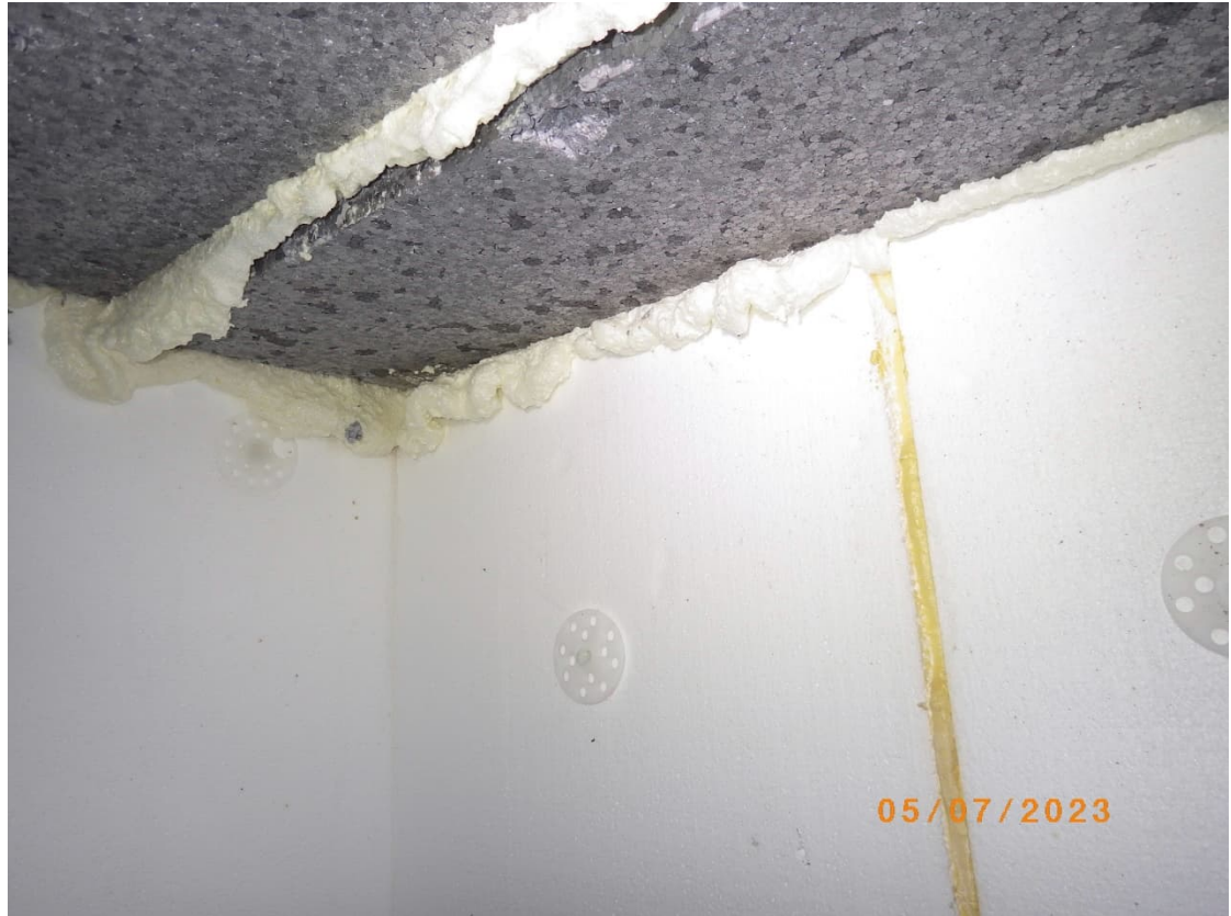
Kuva 9. Alapohjan EPS-eristeet on eristetty polyuretaanivaahdolla. Eristeet olivat lujasti kiinni alustassaan.
