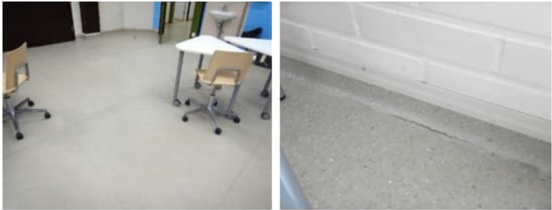
Kuva 53. a-b. Lattioiden pintamateriaalit olivat yleisesti hyväkuntoisia yksittäisiä pintavaurioita lukuun ottamatta.
