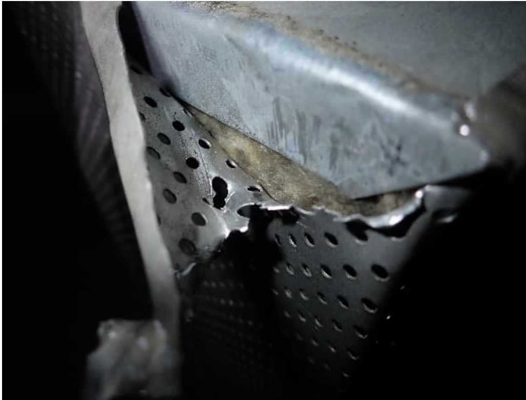
Kuva 166. Tuloilmapuhaltimen jälkeisessä äänenvaimennuskammiossa ei havaittu suojaavaa muovikalvoa reikäpellin ja mineraalivillapintojen välissä.
