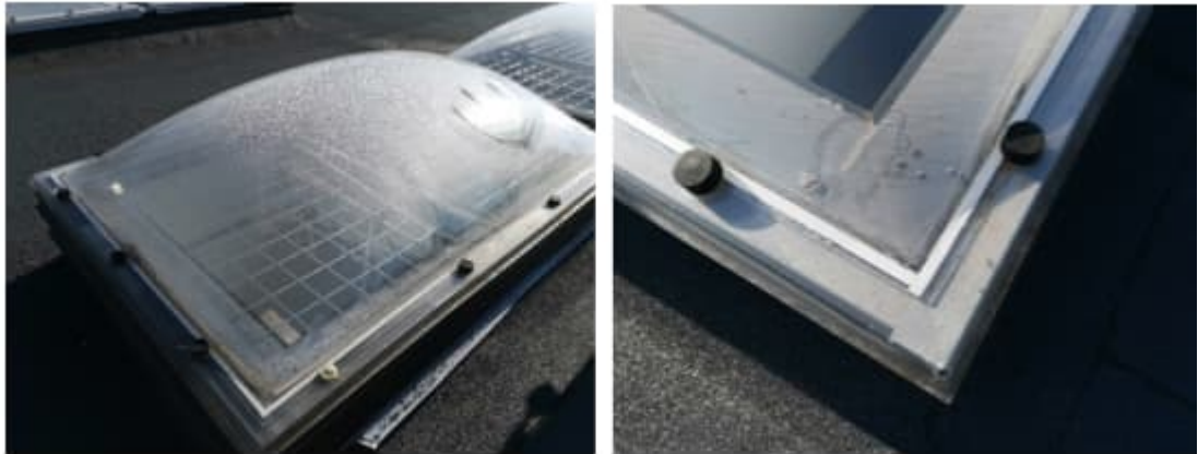
Kuva 73. a-b. Vesikatolla on yhteensä 12 kpl kattokupuikkunoita. Pääosin ikkunat olivat ehjiä ja siistejä. Yksittäisessä kuvassa havaittiin veden kondensoitumista muovikupujen välille, sekä muutamissa kuvuissa mahdollisesti vanhasta vuodosta peräisin olevia kosteusjälkiä.
