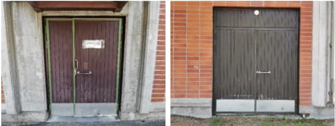
Kuva 76. a-b. Ulko-ovien puupinnoissa havaittiin maalipintojen kulumaa. Liikuntasalin varastoon johtavan oven ja betonisokkelin liittymissä havaittiin rakoilua ja salin puolella homeen hajua.
