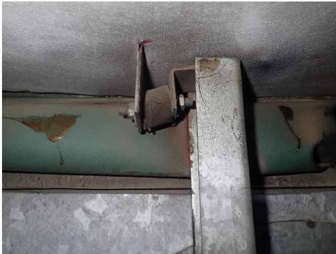
Kuva 154. Tuloilmakoneen tärinävaimentimet ovat haurastuneet ja ratkeilleet.
