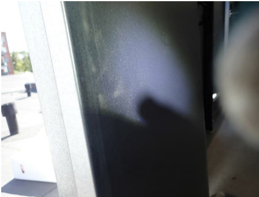
Kuva 128. Suodattimien ohivirtaukseen viittaavia vuotojälkiä suodatinkammion ovesta.
