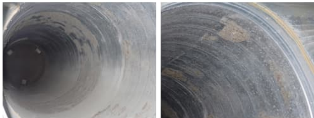
Kuva 172 a-b. Poistoilmakanavistossa havaittiin runsaasti pölykertymää.
