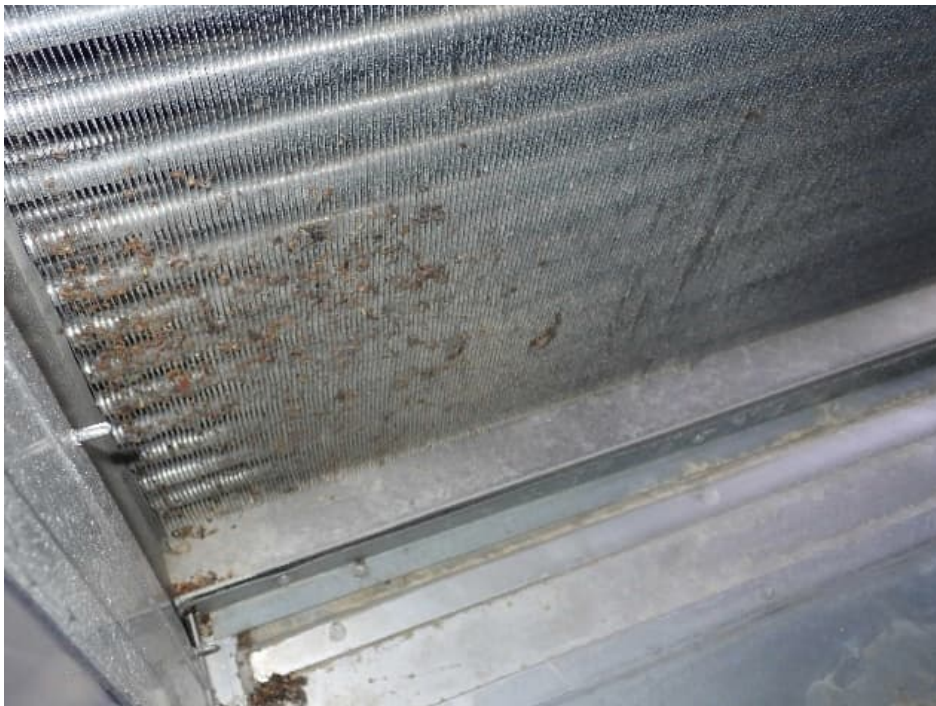
Kuva 130. Lämmityspatterissa havaittiin kuolleita hyönteisiä, siitepölyä, likaa ja kosteusjälkiä.
