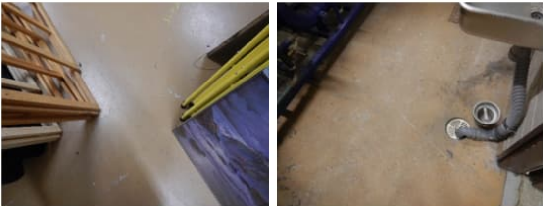
Kuva 26. a-b. [REDACTED] sähköpääkeskuksen 015 lattian betonipinnan maalipinta on kulunut, laatussa havaittiin myös halkeamia.
