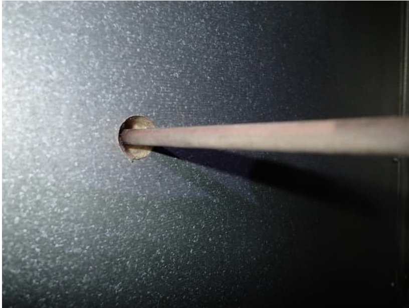
Kuva 167. Anturiläpivientejä ei ole tiivistetty ja niissä on suojaamatonta mineraalivillaa.
