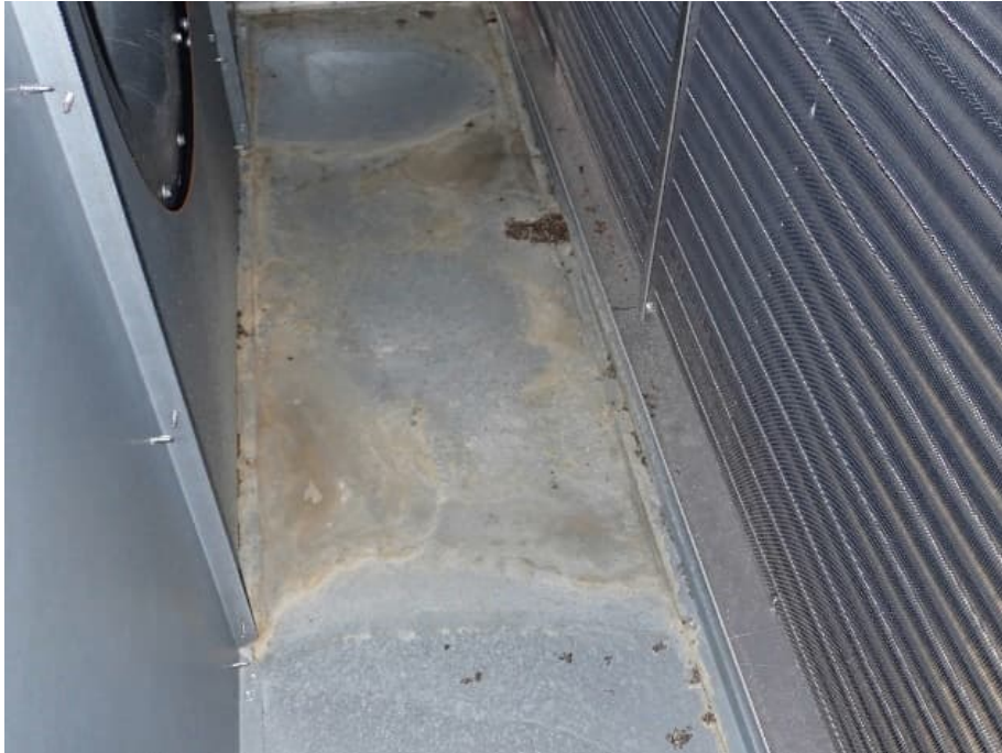
Kuva 131. Tuloilmakoneen lämmityspatterin ja puhaltimen välisessä kammiossa havaittiin likaa, kuolleita hyönteisiä ja kosteusjälkiä.
