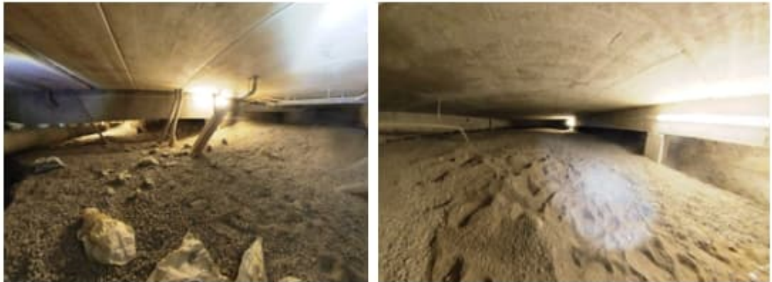
Kuva 30. a-b. Muulla osalla alustatilat olivat pääosin siistit. Viemäreiden kannakoinneissa havaittiin puutteita. Liikuntasalin alapohjan alapinnassa ei ollut rakennesuunnitelmien mukaisia lämmöneristeitä.
