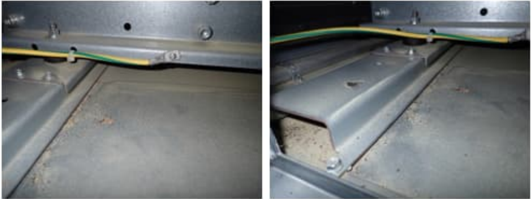
Kuva 159. Puhallinkammiossa havaittiin runsaasti siitepölyä, ulkoilman epäpuhtauksia ja likaa.
