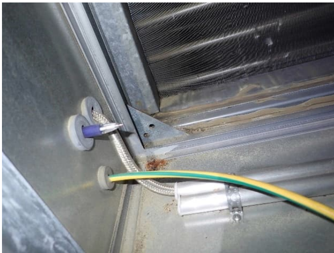
Kuva 160. Tuloilmakoneen puhallinkammiossa on avoin läpivienti, josta aiheutuu ilmavuotoa.
