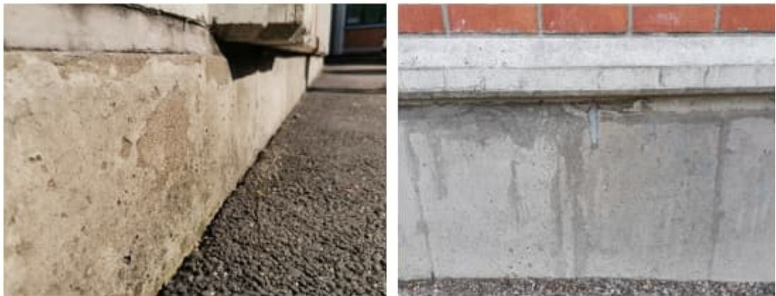
Kuva 65. a-b. Betonisokkeleiden betonipinnoissa havaittiin pintojen kulumaa sekä likaisuutta. Liikuntasalin vastaisen sokkelin ulkopinnassa näkyvissä muoviputki (rakennuksen pohjoissivu).
