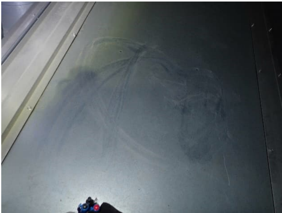
Kuva 132. Poistoilmapuhaltimen puhallinkammiossa havaittiin vanhoja kosteusjälkiä ja pölykertymää.
