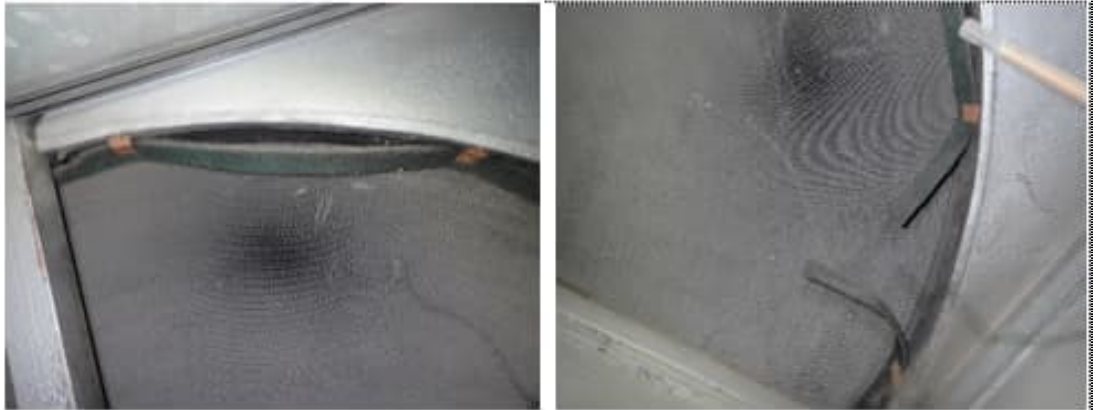
Kuva 140 a-b. LTO-kiekkossa havaittiin pölykertymää ja painaumia.
