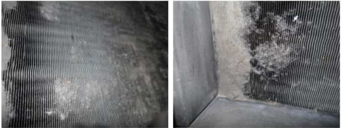
Kuva 158. Lämmityspatterissa havaittiin painauma ja runsaasti likakertymää.
