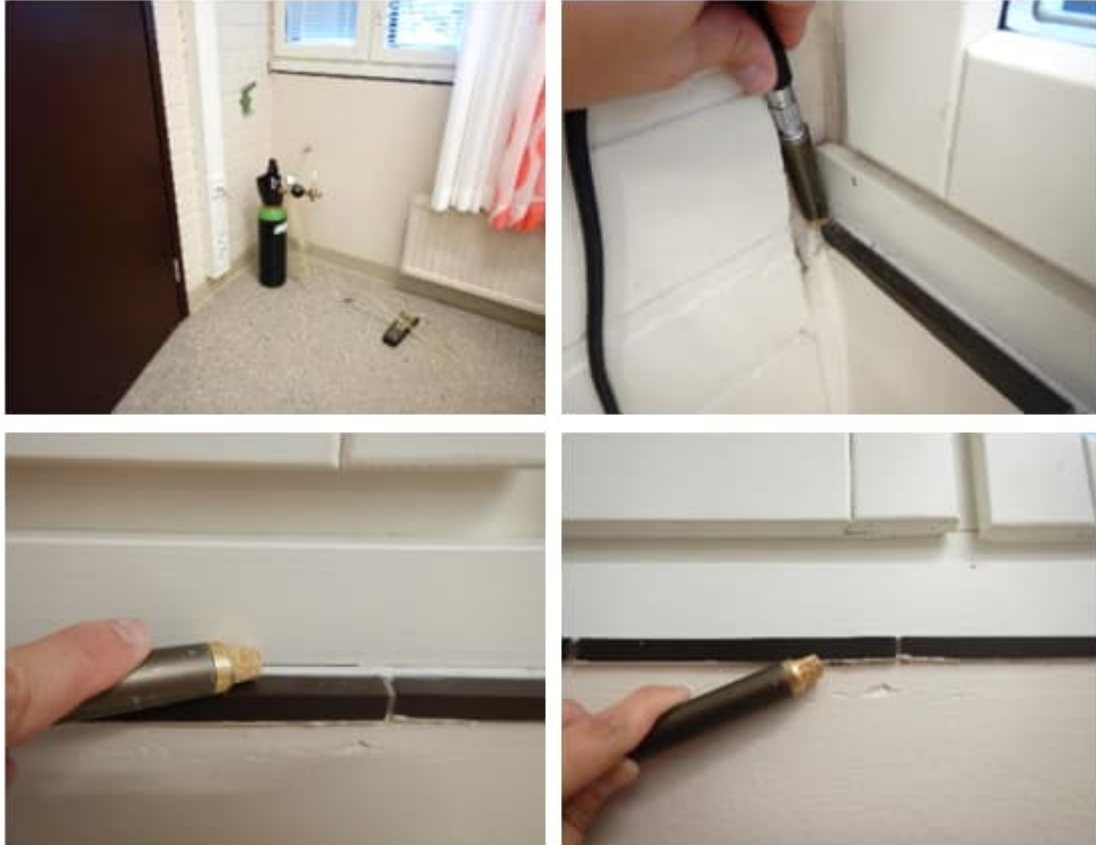
Kuva 90. a-d. Merkkiainekoe MK1 tilan 043 ulkoseinärakenteeseen. Vähäisiä vuotoja havaittiin ikkunaliittymistä sekä ikkunalaudan liittymien rakoilevasta elastisesta saumamassasta sekä yksittäinen pistemäinen vuoto patterikiinnikkeestä.
