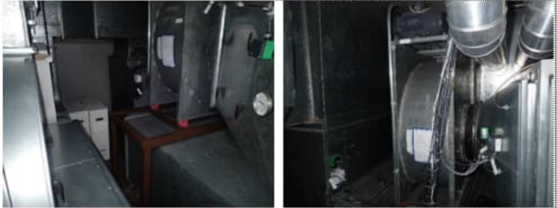
Kuva 133 a-b. Yleiskuvat ilmanvaihtokonepaketista TK3 TF01 ja PF01
