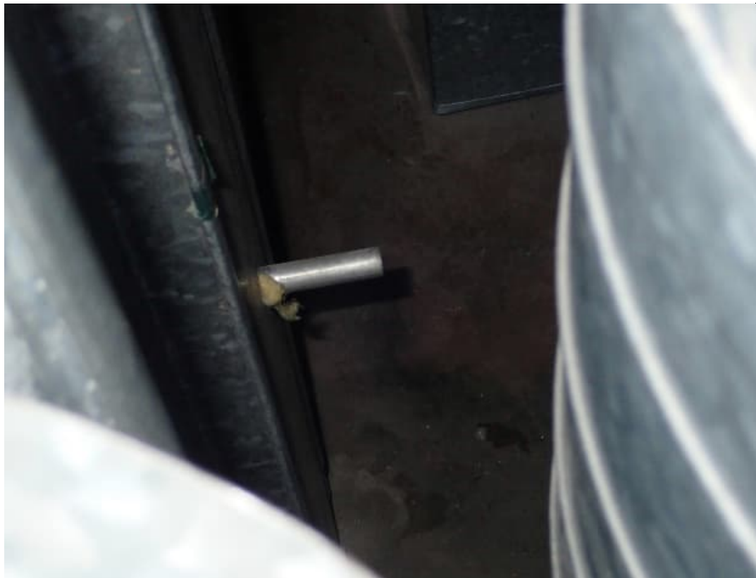
Kuva 144. Anturiläpivientejä ei ole tiivistetty ja niissä on suojaamatonta mineraalivillaa.
