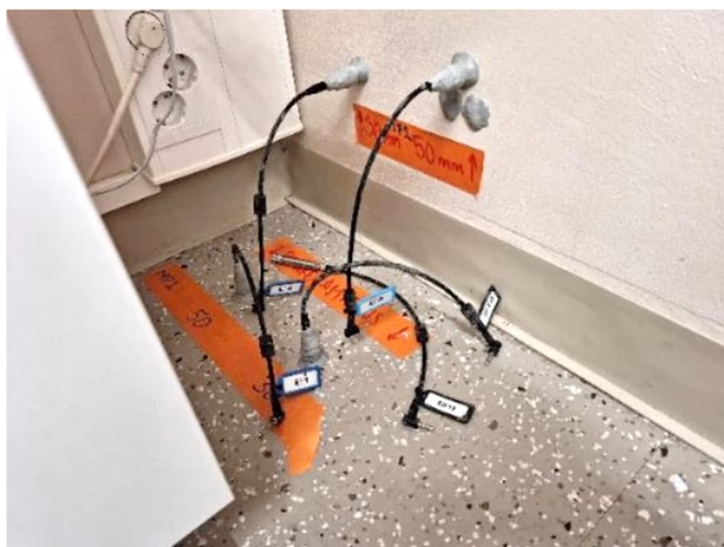
Kuva 77. a-b. Porareikämittaukset luokkatilan 009 ulkoseinän alaosaan. Mittapisteet seinään (E2: 58,2 %RH ja E3: 58,6 %RH).
