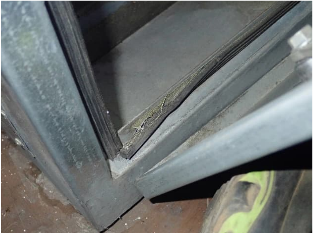
Kuva 148. Tarkastusluukkujen tiivisteet ovat rispaantuneet ja siitä aiheutuu ilmavuotoja.
