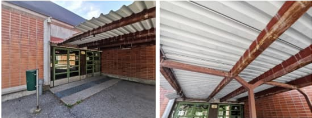
Kuva 8. a-b. Sisäänkäyntien teräksisissä katosrakenteissa havaittiin ruostevaurioita sekä runsaasti peltikatteen eriasteista vääntymistä.
