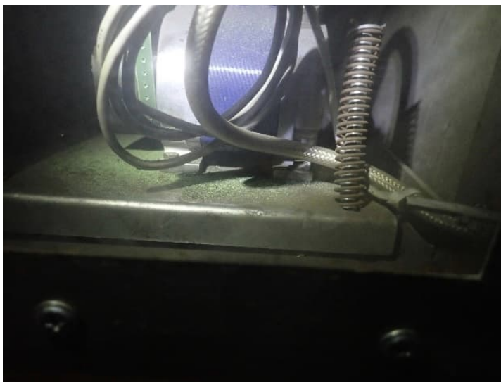
Kuva 139. LTO-kiekon alla havaittiin hihnamursketta
