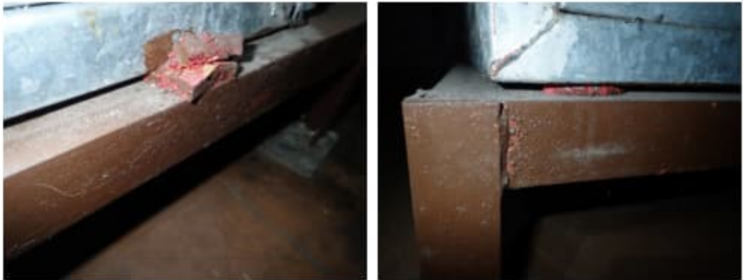
Kuva 165 a-b. Tuloilmakoneen tärinänvaimentimet ovat ratkeilleet ja haurastuneet.
