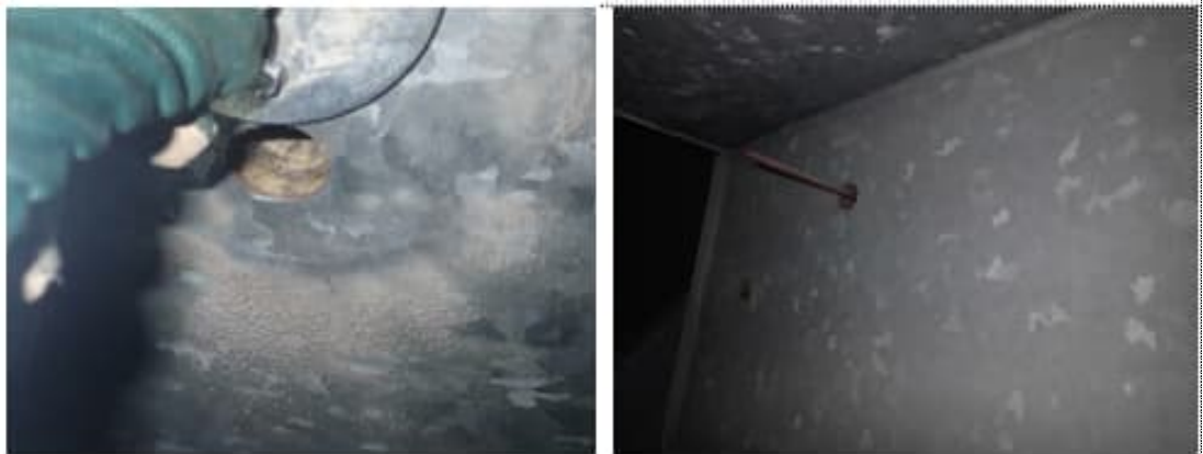
Kuva 155 a-b. Anturiläpivientejä ei ole tiivistetty ja niissä on suojaamatonta mineraalivillaa.
