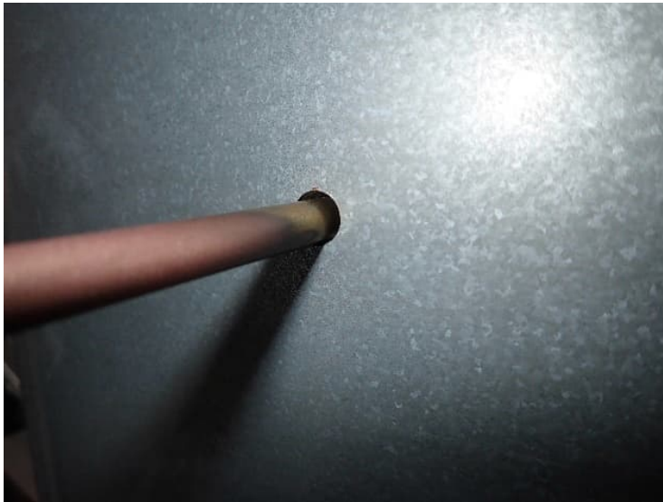
Kuva 126. Anturiläpivientejä ei ole tiivistetty ja niissä on suojaamatonta mineraalivillaa.
