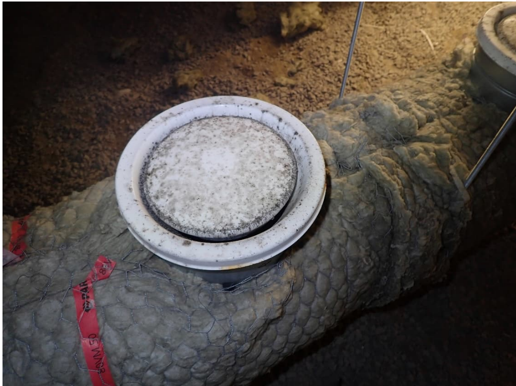
Kuva 177. Pohjoisen alustatilan (liikuntasali) poistoilmaventtiilit eivät ole täysin auki. Suosittelemme avaamaan poistoilmaventtiilit ääriasentoon
