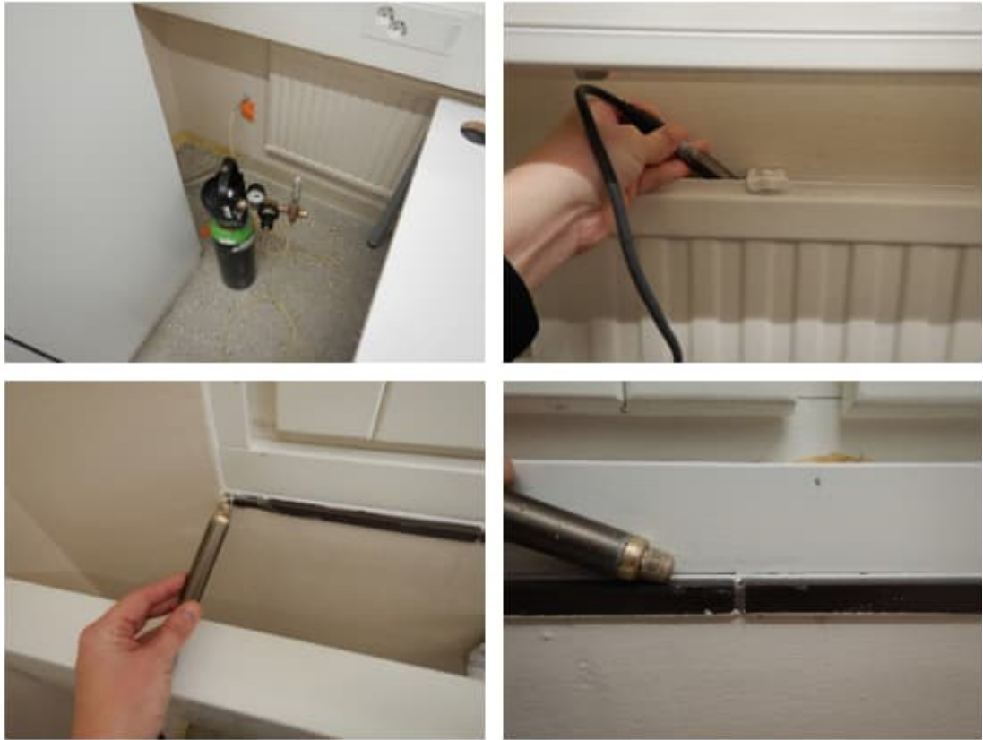
Kuva 93. Merkkiainekoe MK8 tilan 030 ulkoseinärakenteeseen. Vähäisiä vuotoja havaittiin ikkunaliittymistä sekä yksittäinen vuoto patterikiinnikkeestä.
