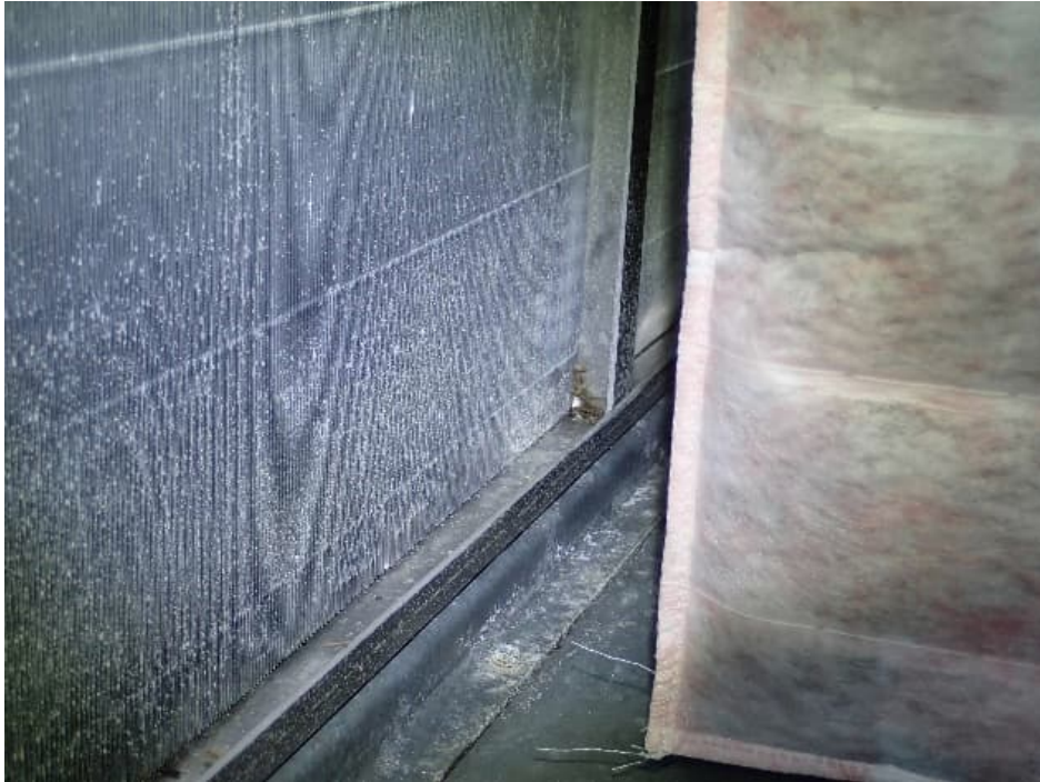
Kuva 129. Tuloilmapuhaltimen LTO-patterissa havaittiin siitepölyä, kuolleita hyönteisiä ja kosteusjälkiä.
