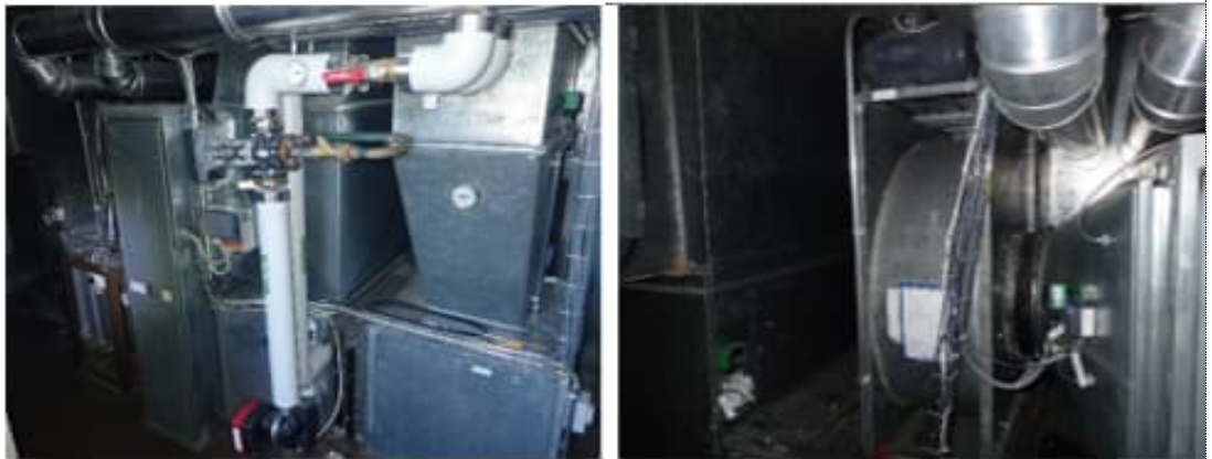
Kuva 145 a-b. Yleiskuvat ilmanvaihtokonepaketista TK3 TF01 ja PF01
