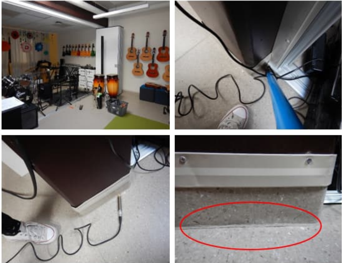
Kuva 62. a-d. Merkkiainekoe MK4 tilan 127 välipohjarakenteeseen. Voimakkaita pistemäisiä vuotoja havaittiin pilarin ja välipohjalaatan liittymistä joissa muovimaton saumat rakoilivat.
