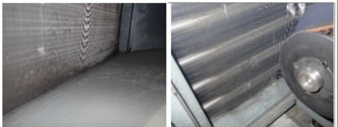
Kuva 152 a-b. Lämmityspatterissa havaittiin likaa ja kolhuja.
