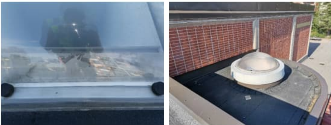
Kuva 74. a-b. Keittiön kattoikkunan sisäpuolisissa rakenteissa havaittiin myös mahdollisesti vanha kosteusjälkiä. Peruskorjauksen rakennesuunnitelmien mukaan porrashuoneen kattokuvun ylösnostoja sekä pellityksen kallistuksia on parannettu.
