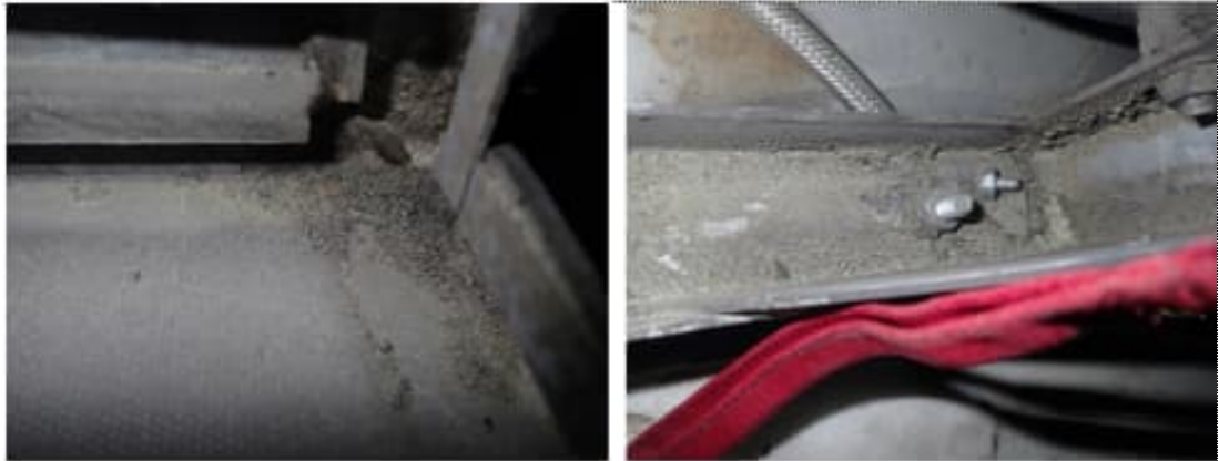
Kuva 153 a-b. Tuloilmakoneen puhallinkammiossa havaittiin likaa, pölyä ja roskia.
