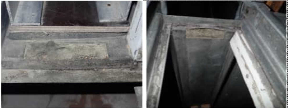
Kuva 147 a-b. Ilmanvaihtokoneen tarkastusluukkujen lukkopesissä on suojaamatonta mineraalivillaa.
