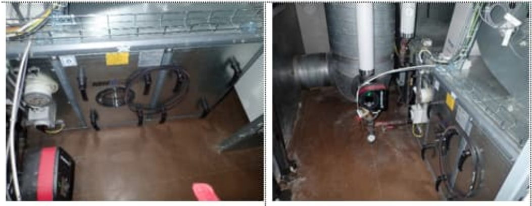
Kuva 156 a-b. Yleiskuva ilmanvaihtokoneesta TK05 TF01.
