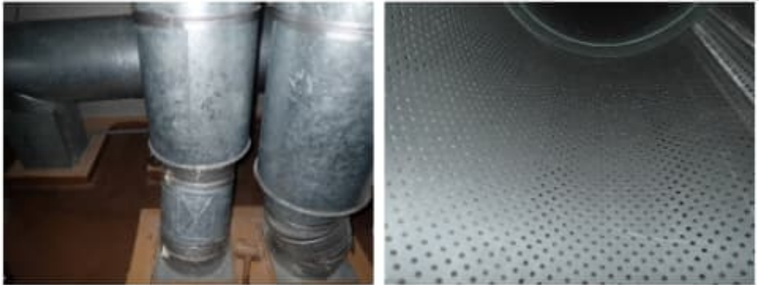
Kuva 170 a-b. Vesikaton ilmanvaihtokonehuoneissa sijaitsevia alkuperäisiä kanavaosuuksia ja äänenvaimentimia. Äänenvaimentimissa ei havaittu suojaavaa muovikalvoa tai vastaavaa mineraalivillapintojen ja reikäpellin välissä. Myöskään pölynsidontakäsittelystä ei havaittu jälkiä.
