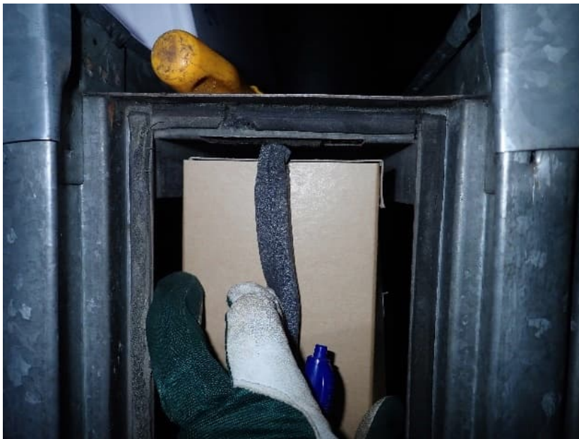
Kuva 157. Tuloilmakoneen suodatinkehikon ja kasettisuodattimen välinen tiiveys on puutteellista, ja siitä aiheutuu runsaasti ohivirtausta.
