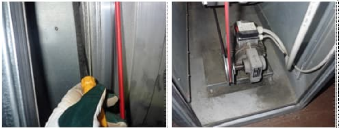
Kuva 149. LTO-kiekon harjatiivisteet ovat kuluneet ja rispaantuneet. LTO-kiekon alla havaittiin pölyä, likaa ja voiteluainejäämiä.
