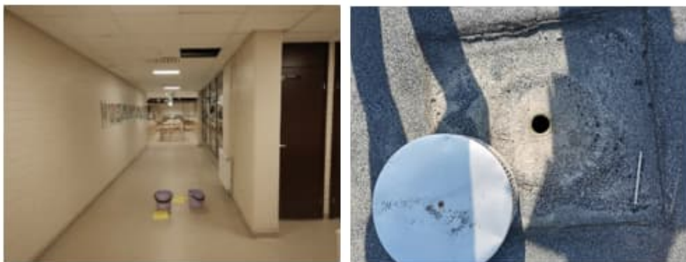
Kuva 110 a-b. Käytävän kohdalta ennen tutkimuksia oli huoltomiehen ja käyttäjän mukaan tullut alaslaskutilan kautta vettä käytävän lattialle.
