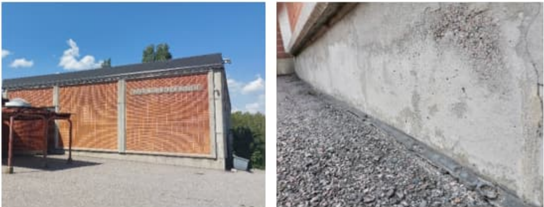
Kuva 7. a-b. Liikuntasalin puoleisen asfaltoinnin kallistuksia ei havaintojen mukaan ole parannettu peruskorjauksessa mainitun mukaisesti. Sokkelirakenteen ja asfaltoinnin välillä olevaan rakoön on asennettu elastinen saumamassa mutta pinnassa on havaittavissa rapautumaa, mikä oli paikoin irronnut.
