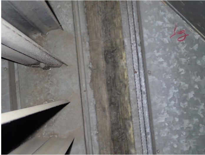
Kuva 137. Suodatinkammiossa on suojaamatonta mineraalivillaa.
