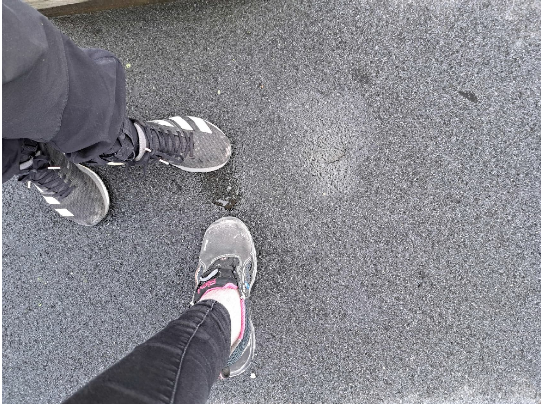
Kuva 116 a-c. Bitumikermikatteessa havaittiin paikallisia vaurioita, joissa kermi on leikkaantunut rikki ja kermien väliin päässyt vettä.
