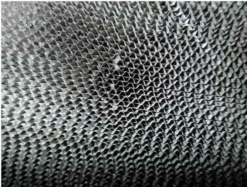
Kuva 163. LTO-kiekkossa havaittiin pölykertymää.
