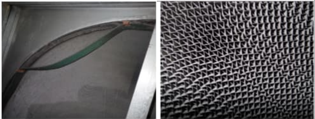
Kuva 138 a-b. LTO-kiekon harjatiivisteet ovat kuluneet ja rispaantuneet.
