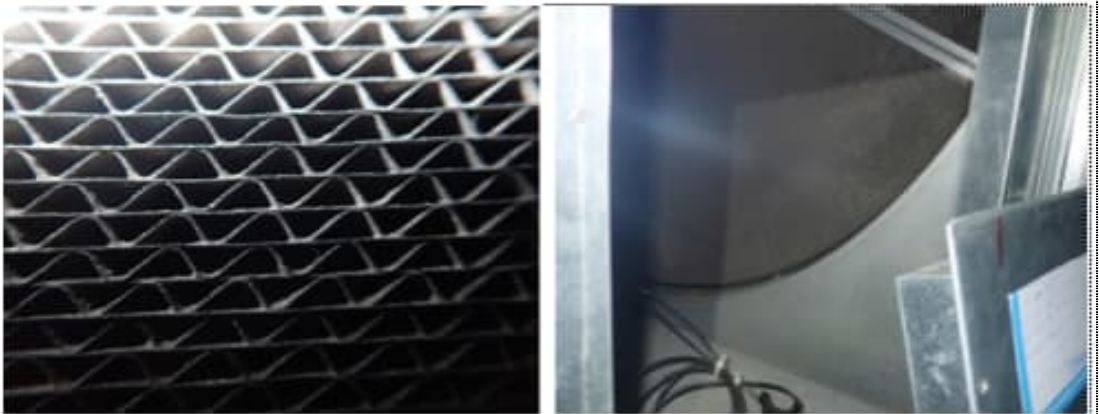
Kuva 151 a-b. LTO-kiekoissa havaittiin pölykertymää
