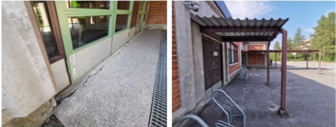
Kuva 6. a-b. Sisäänkäyntien betonilaatoissa, ovien edustalla havaittiin betonilaattojen halkeilua. Keittiön oven edustalta vanha betonilaatta on poistettu. Asfaltointi on uusittu keittiön edustalta peruskorjauksen suunnitelmien mukaisesti.
