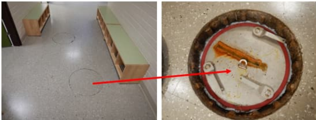
Kuva 22. a-b. Pohjakerroksen käytävän kaivojen alimmat kannet on uusittu peruskorjauksen yhteydessä kaasutiiviiksi luukuiksi. Päällimmäisen kannen avaamisen yhteydessä havaittiin lievää hajua.
