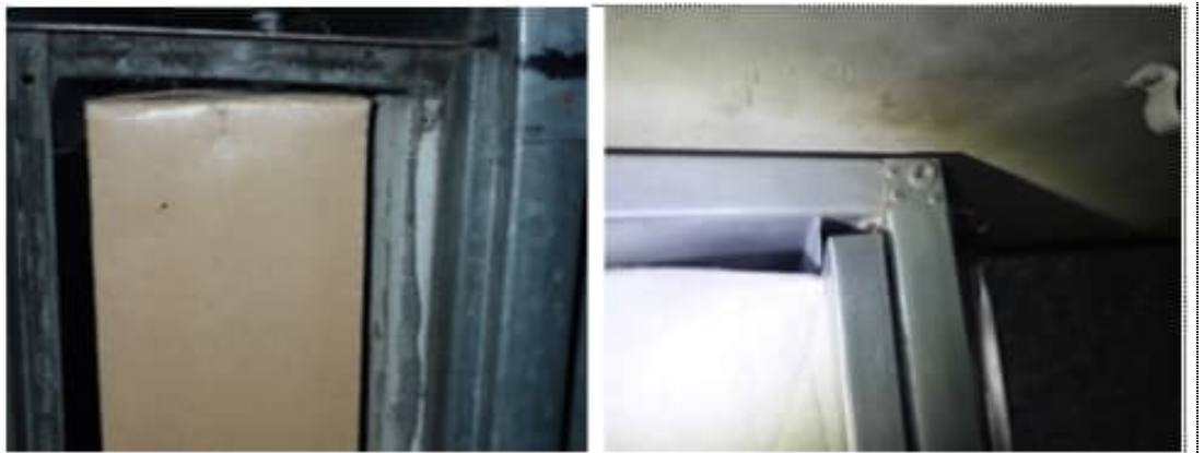
Kuva 146 a-b. Suodatinkehikoiden ja kasettisuodattimien välinen tiiveys on puutteellista ja siitä aiheutuu runsaasti ohivirtausta.
