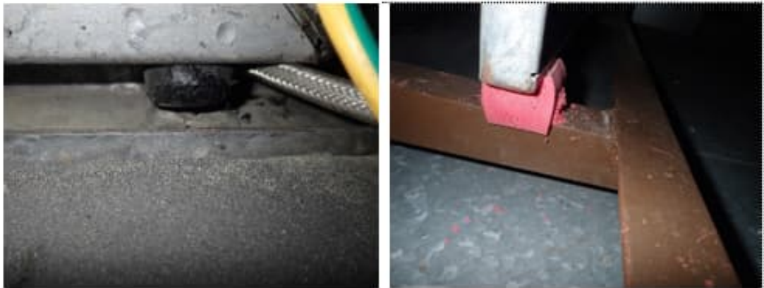
Kuva 143. Tulo- ja poistoilmakoneiden tärinänvaimentimet ovat haurastuneet ja ratkeilleet.
