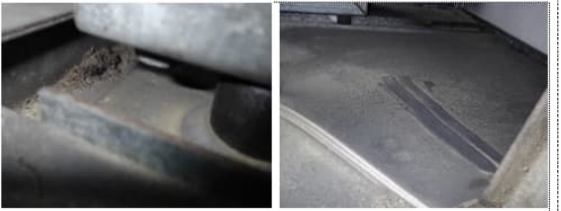
Kuva 142 a-b. Tuloilmakoneen puhallinkammiossa havaittiin likaa, pölyä ja roskaa.
