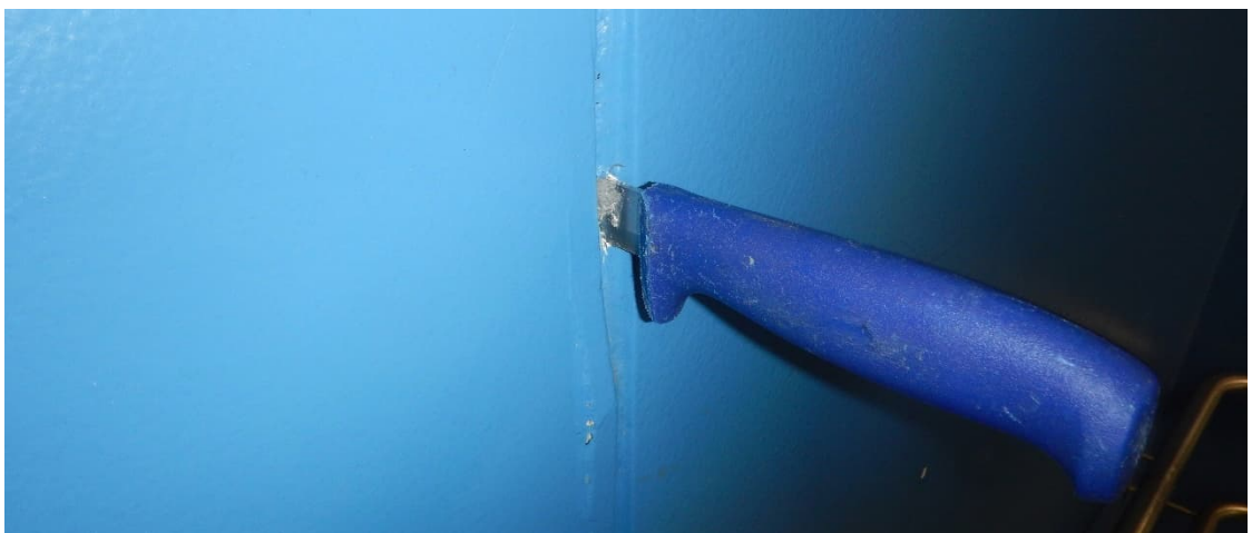
Kuva 32. Kellarin rappusissa ennen tilaa 026 todettiin rakoilua ja tiivistyspuutteita rakenteen saumassa. Saumasta on todennäköisesti
