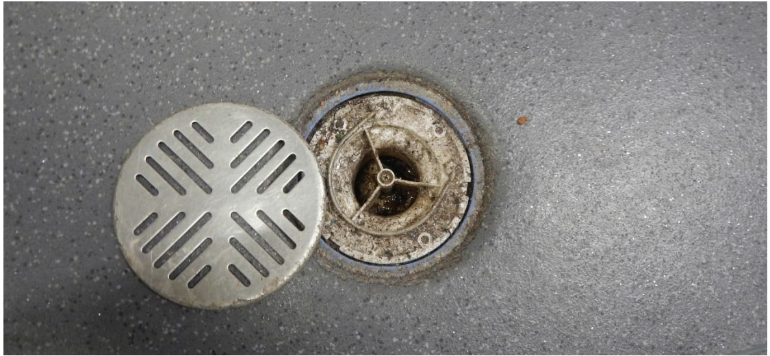
Kuva 15. Tilassa 168 tarkistettiin pukuhuoneen lattiakaivo, joka todettiin erittäin likaiseksi. Hajua ei tai ilmavirtaa huonetilaan ei todettu.
