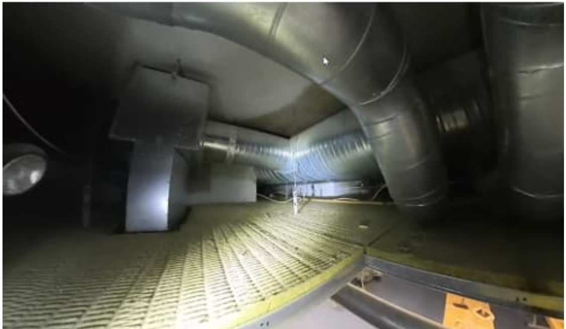
Kuva 58. Rakennuksen kellarissa, tilassa 011 Puu/met.työ, on alaslaskettu katto. Alaslaskutilaa tutkittiin katossa olleen avoimen kohdan kautta. Alaslaskulevyjen yläpinnat ovat kokonaisuudessaan avoimia mineraalivillapintoja. Avoimia mineraalivillapintoja ei havaittu muissa tiloissa.
