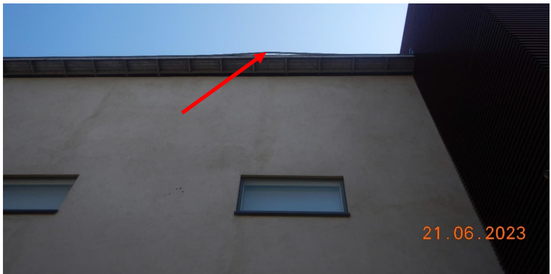
Kuva 38. Pohjoisjulkisivun räystäällä yksittäinen räystäspeltti on huonosti kiinni.
