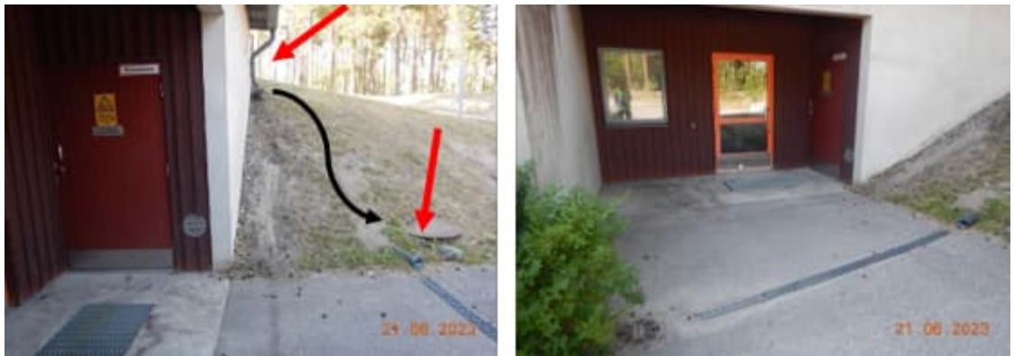
Kuva 6. Rakennuksen itäpäädyssä on kulku kellarissa sijaitsevaan teknisentyön tiloihin. Kohdalla on matala katto-osuus, jonka sadevedet ohjataan putkea pitkin lähelle kellarin sisäänkäyntiä. Sisäänkäynnin edustalla oli jälkiä veden lammikoitumisesta.
