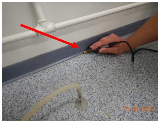
Kuva 25. Merkkiainekoe MK1 tilan 103 alapohjaan. Havaittiin yksittäinen pistemäinen vuoto.
