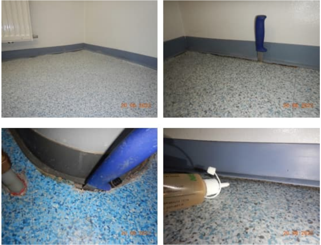
Kuva 17. Alapohjarakenteen ja ulkoseinien rakenneliitoksessa oli paikoin havaittavissa kohoumia. Lisäksi havaittiin selkeitä rakoja seinä-lattiarakenneliittymässä kuin pilari-lattiarakenneliittymissä. Merkkisavulla tutkittuna ei havaittu selkeitä ilmavirtauksia näiltä alueilta sisäilmaan. Myöskään maaperään viittaavaa hajua ei todettu.
