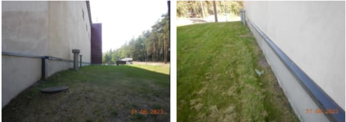
Kuva 5. Pohjoisjulkisivun nurmialueella maa kaataa paikoin kohti sokkelia.
