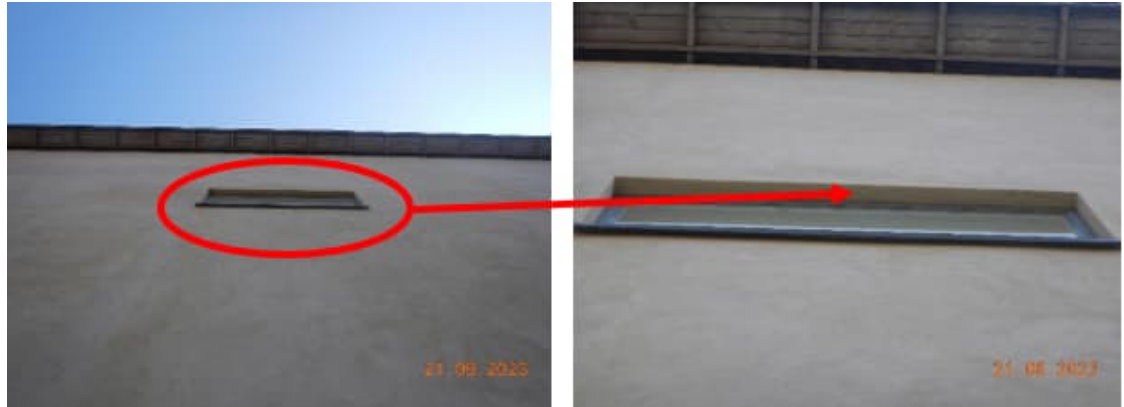
Kuva 39. Julkisivurappauksessa havaittiin yksittäisiä alkavia vaurioita. Rappauksessa halkeama ikkunan yläpuolella koko ikkunan leveydellä.
