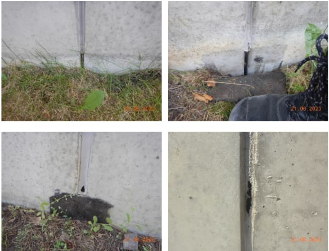
Kuva 41. Sokkelin kuorielementtien saumoihin on asennettu saumamassaa miltei maanpintaan saakka. Siitä alemmas bitumikermiä. Osin sauma on jäänyt kokonaan avoimeksi ja säälle alttiiksi. Osassa saumoja havaittiin myös bitumikerman kiinnityksen olevan heikentynyt ja kermi alkaa irrota betonipinnasta. Lisäksi osassa saumoja saumamassat ovat rakoilleet.
