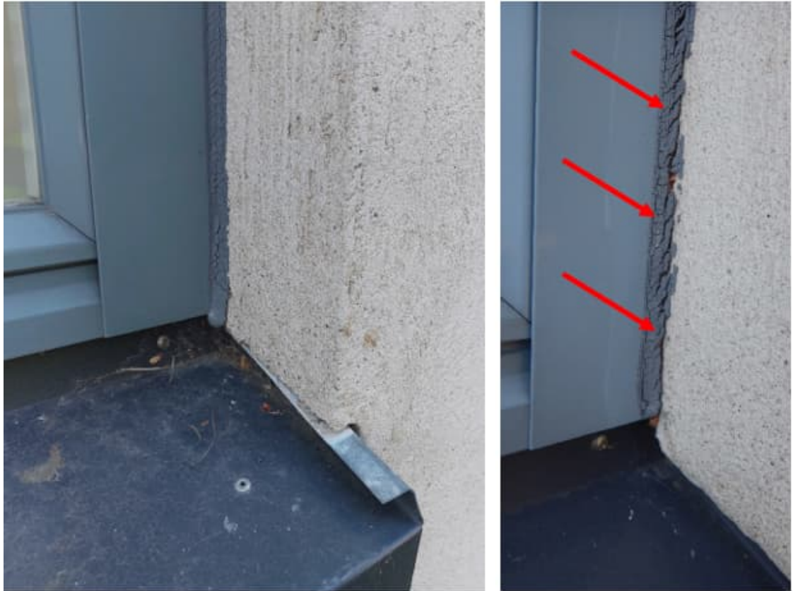
Kuva 44. Ikkunoiden karmiliitokset ja vesipeltien asennus sekä tiiveys on toteutettu asianmukaisesti. Paikoin ikääntyneet saumamassat ovat haurastuneet ja halkeilleet.
