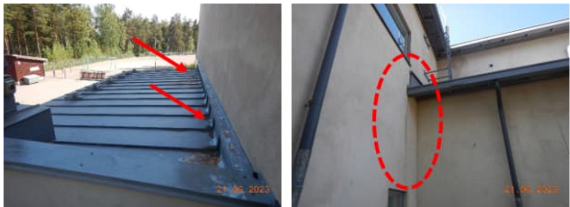
Kuva 40. Rakennuksen itäpäädyssä oleva peltikatto on osin ruosteessa seinällänoston juuresta sekä seinällenostopellityksistä. Rakennuksen itäsivustan keskivaiheilla sadevesikourun päädyn kohdalla on seinän rappauspinnalla tummentumaa ja valumajälkiä.
