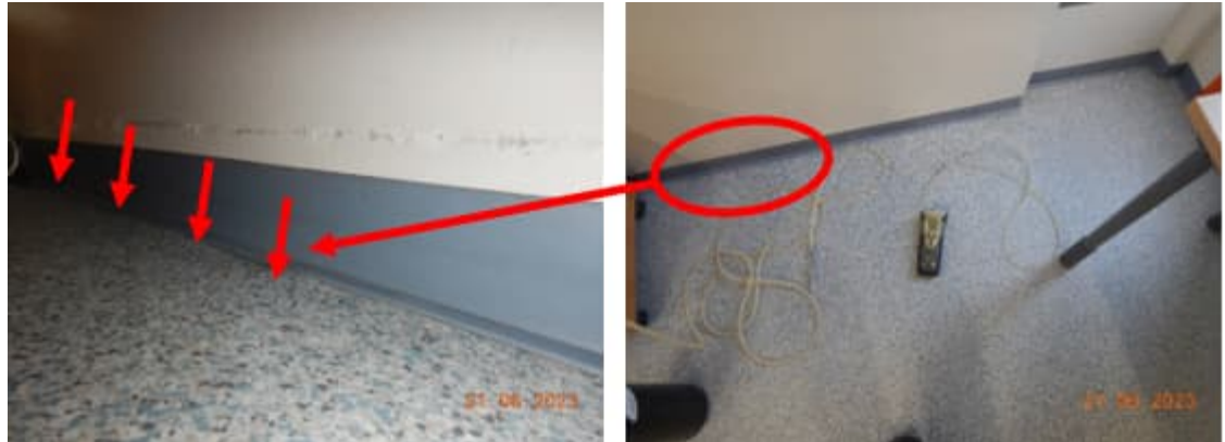
Kuva 26. Merkkiainekoe MK3 tilan 105 alapohjaan. Jalkalistan takaa havaittiin viivamaista vuotoa sekä lattian kohouman kohdalta selkeää vuotoa.
