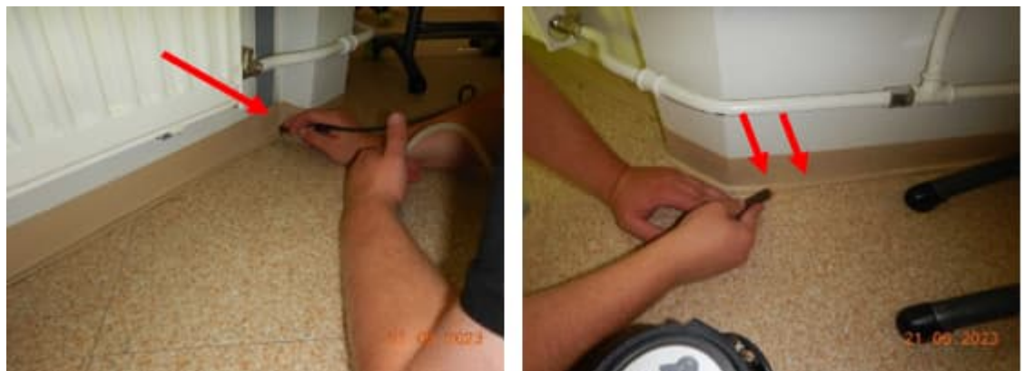
Kuva 27. Merkkiainekoe MK4 tilan 106 alapohjaan. Havaittiin pistemäinen vuoto levyrakenteen liittymässä sekä lattian kohoumassa.
