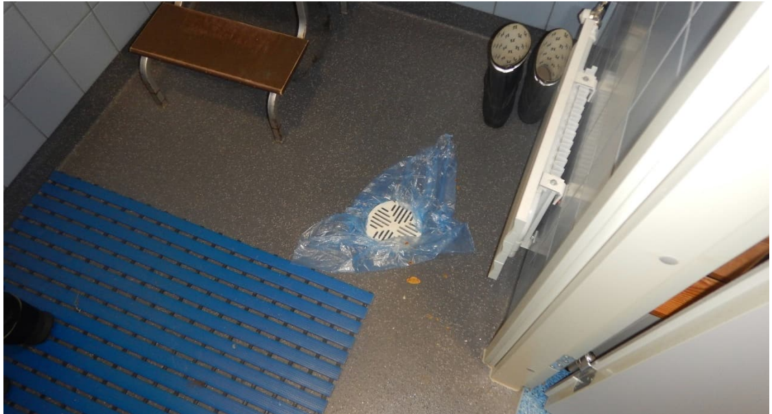
Kuva 13. Tilassa 017 on lattiakaivo, joka on suljettu muovipussilla ja muovisella kaivon kannella.
