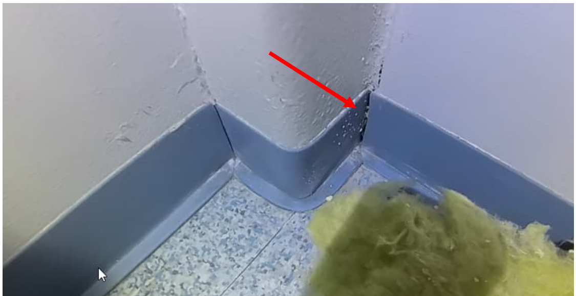
Kuva 50. Kuvassa on esimerkki paikallisista lattianajaan sijoittuvista rakenteiden rakenneliittymien halkeamista. Kohta on tilasta 105 OT-3 levypintaisen ulkoseinän ja pilarin liittymään syntyneestä halkeamasta, jonka kohtaa punainen nuoli osoittaa.
