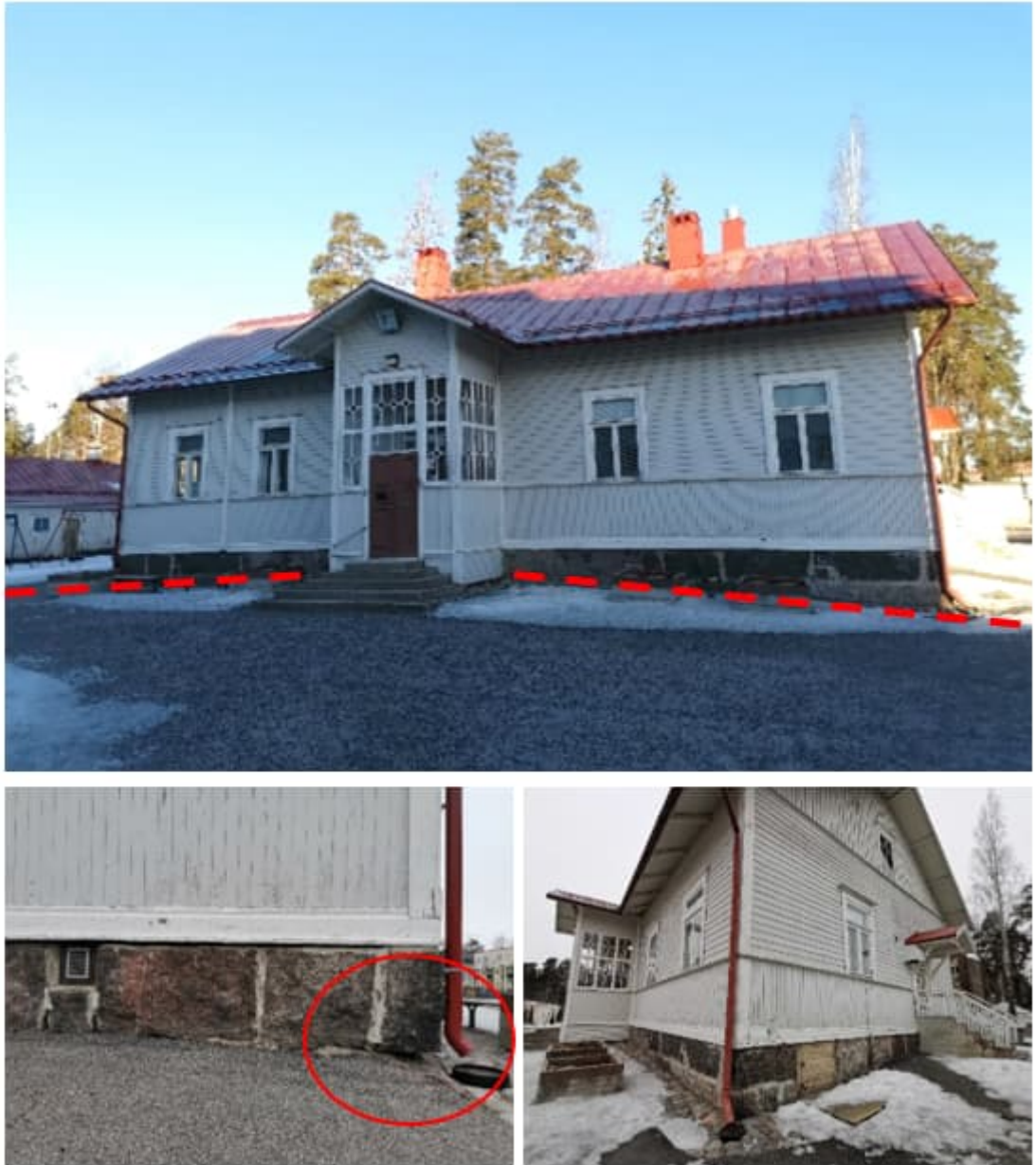
Kuva 2. Rakennusta kiertävät piha-alueet ovat asfaltoidut ja kallistavat yleisesti rakennuksesta poispäin. Pääsisääkäynnin puoleisella julkisivulla, rakennuksen ulkoreunoilta maanpinta on joko painunut ajan saatossa tai sadevesijärjestelmän uusimisen yhteydessä muotoiltu tarkoituksella rakennuksen ulkonurkista muuta maanpintaa alemmaksi.
