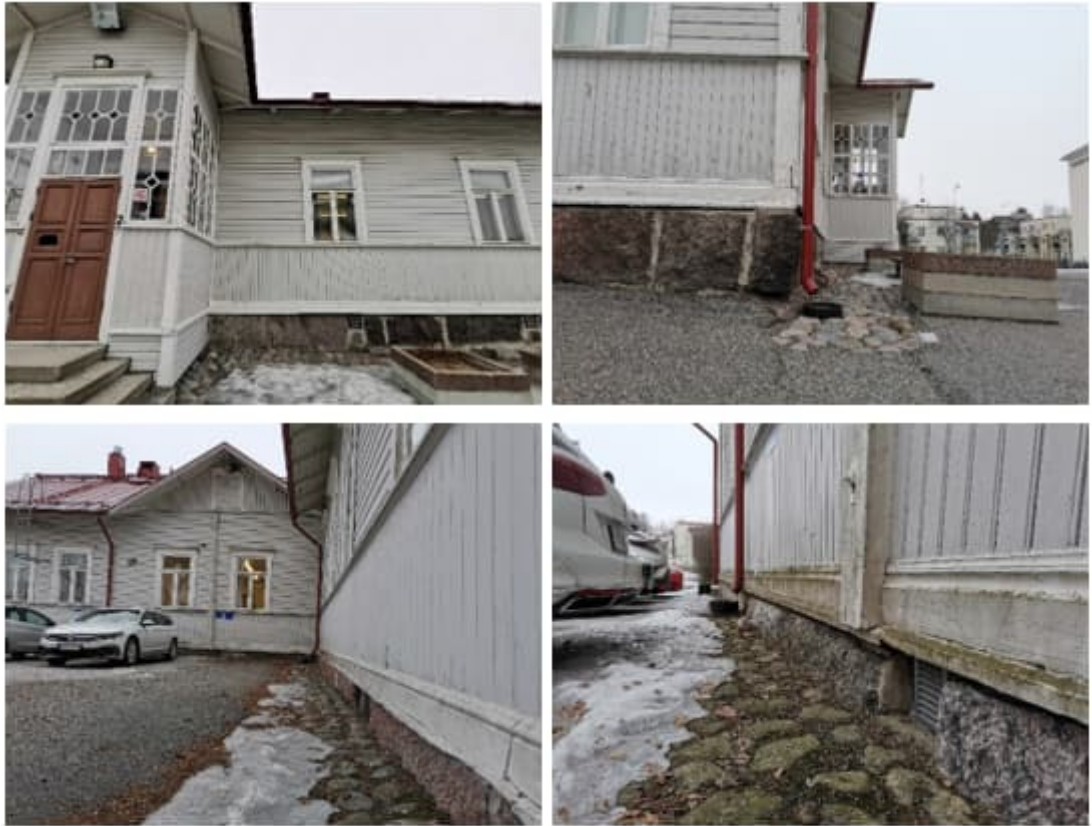
Kuva 3. Rakennuksen pohjois- ja eteläsivun vierustat ovat kivetetty mukulakivin. Kiveyksessä havaittiin kivien välisen maan/hiekan painumia sekä maanpinnan olevan kiveyksen osalta yleisesti melko tasainen.
