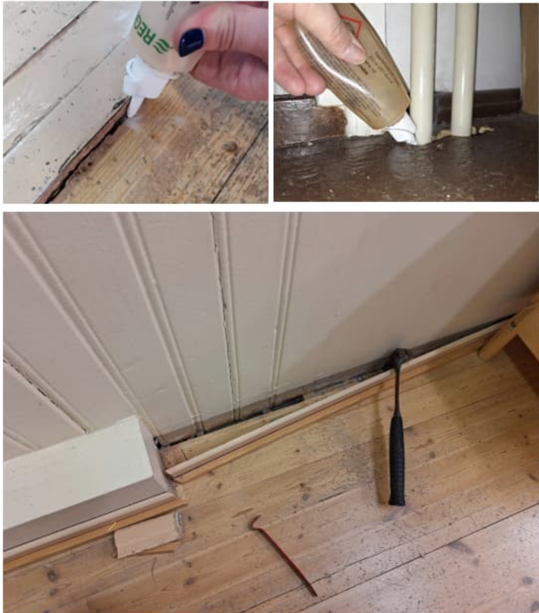
Kuva 9. Läpiviennit, väliovien kynnysliittymät sekä jalkalistojen taakse jäävät rakenneliittymät ovat aistinvaraisten havaintojen mukaan pääosin kaikki epätiivittä. Avoimista liittymistä havaittiin paikoin voimakkaita ilmavirtauksia tuulettuvasta alapohjatilasta käyttötiloihin.
