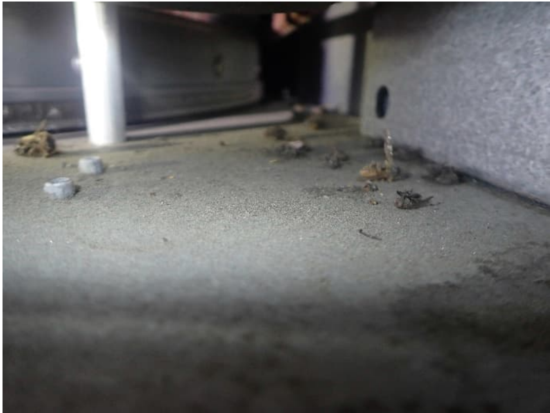
Kuva 62. Tuloilmakoneen LTO-kammiossa havaittiin kuolleita hyönteisiä, siitepölyä, kosteusjälkiä ja pölyä.
