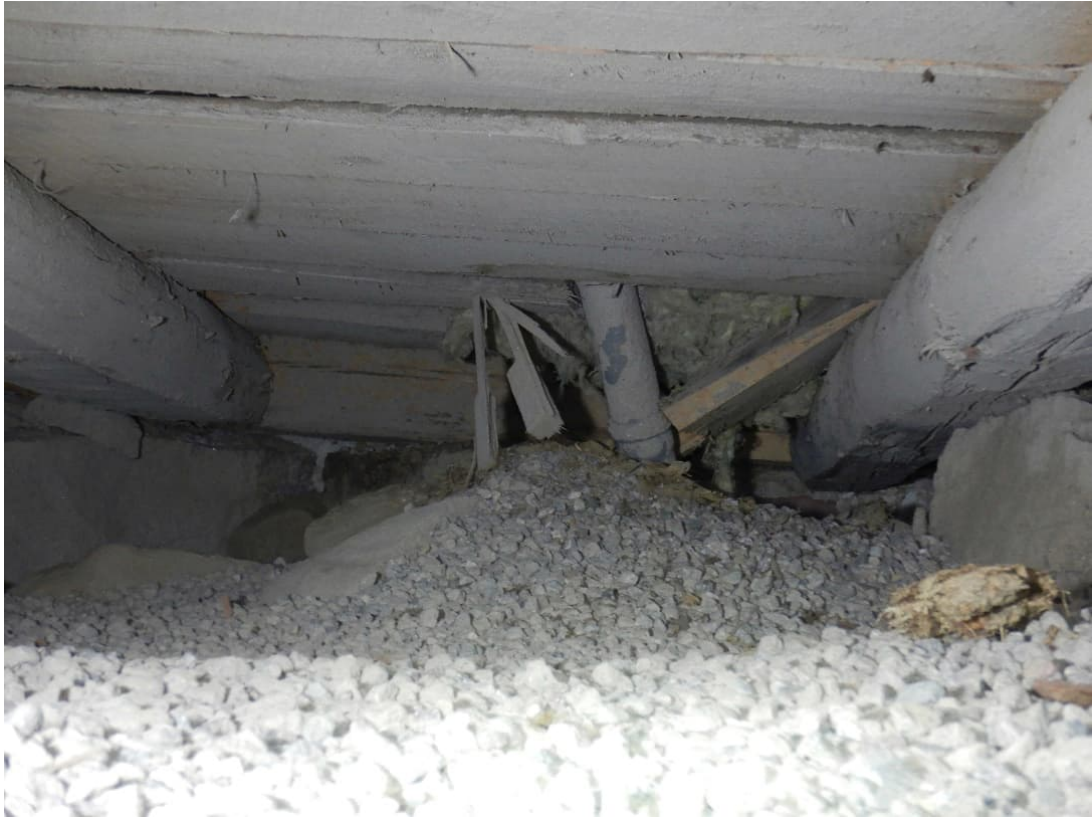
Kuva 20. Yleisesti alapohjan läpiviennit ovat aistinvaraisten havaintojen mukaan epätiivitä ja epämääräisesti toteutettuja.
