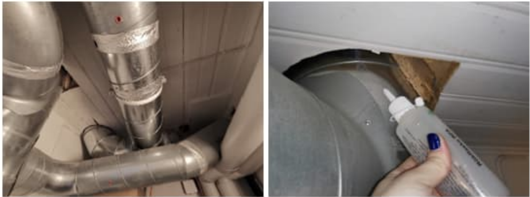
Kuva 40. Siivousskomerossa on runsaasti avoimia iv-putkiläpivientejä yläpohjaan. Havaintojen mukaan ilmavirtaus on tilasta yläpohjaan päin.
