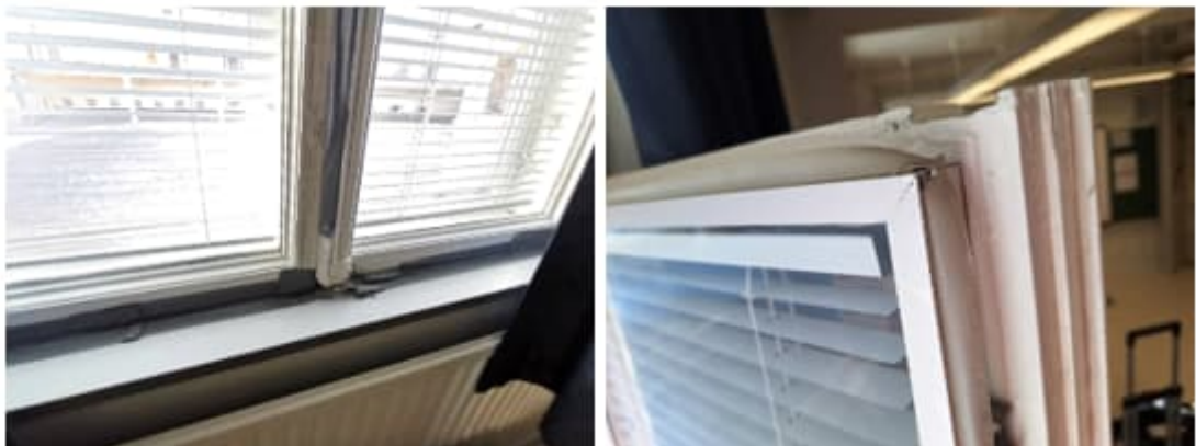
Kuva 32. Sisäpuolelta ikkunoista havaittiin vetoa ja paikoin ikkunoita onkin teipattu vedon tunteen vähentämiseksi. Tilan 113P ikkunoissa havaittiin lisälasi ja lisälasissa muovinen tiiviste, joka haisi voimakkaasti epämiellyttävältä auringon lämmittäessä ikkunaa.
