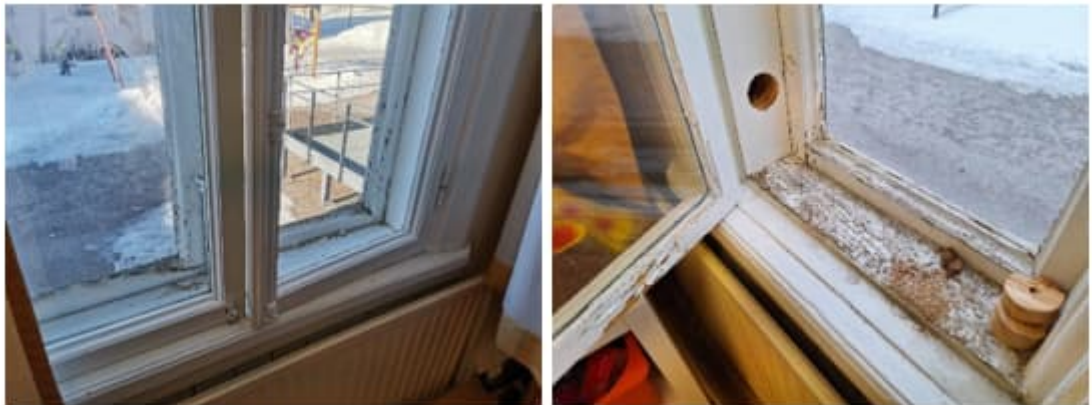
Kuva 31. Ikkunoiden käynneissä havaittiin paikoin merkittäviä puutteita, eikä kaikkia sisäpuitteita saatu kiinni. Maalipintojen hilseilyä havaittiin paikoin ulkopuitteiden lisäksi myös sisäpuitteissa.
