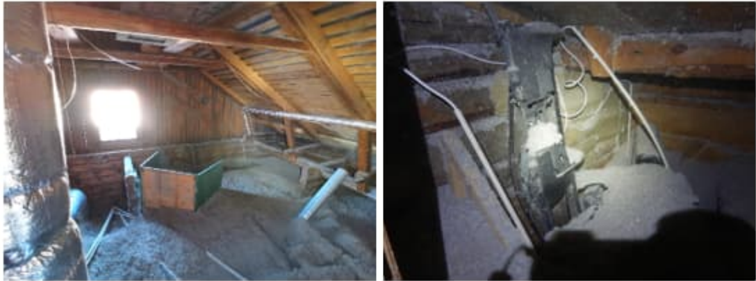
Kuva 47. Selluvillaeristeen seassa on auton kromilistoja, istuimet ja kojelauta sekä yleisesti muuta rakennusjätettä.
