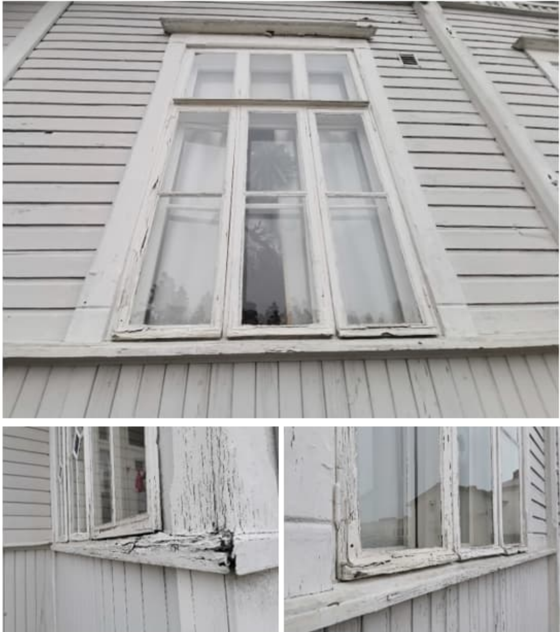
Kuva 30. Ikkunoiden ulkopuitteissa ja peitelistoissa on runsaasti puurakenteiden vaurioitumista sekä maalipintojen hilseilyä rakennuksen etelä- ja länsisivuilla. Varsinkin maalipinnan kunto on yleisilmeeltään heikko. Rakennuksen pohjois- ja itäisivuilla ikkunoiden ulkopuitteet ovat tyydyttävässä kunnossa.
