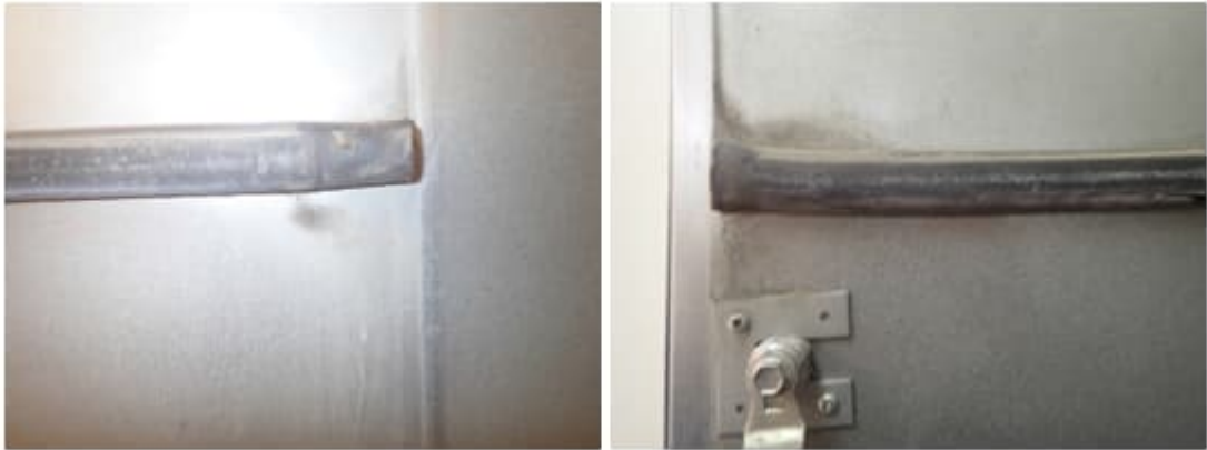
Kuva 60. Tulosuodattimien ja ilmanvaihtokoneen oven/tarkastusluukun välinen tiiveys on puutteellista, ja siitä aiheutuu ohivirtausta.
