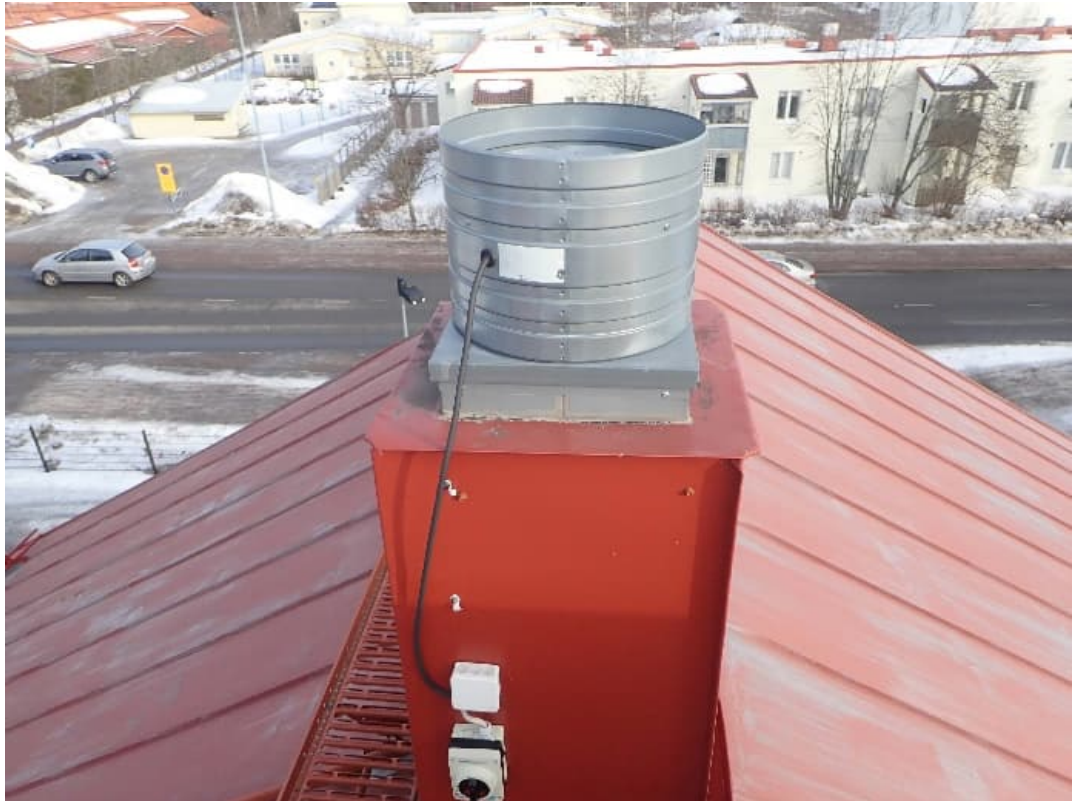
Kuva 68. Yleiskuva vesikatolla sijaitsevasta huippuimurista.
