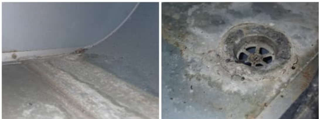
Kuva 63. Lämmityspatterin jälkeisessä kammiossa havaittiin mahdollisesti jyrsijäperäisiä jätöksiä, ulkoilman epäpuhtauksia ja kosteusjälkiä.
