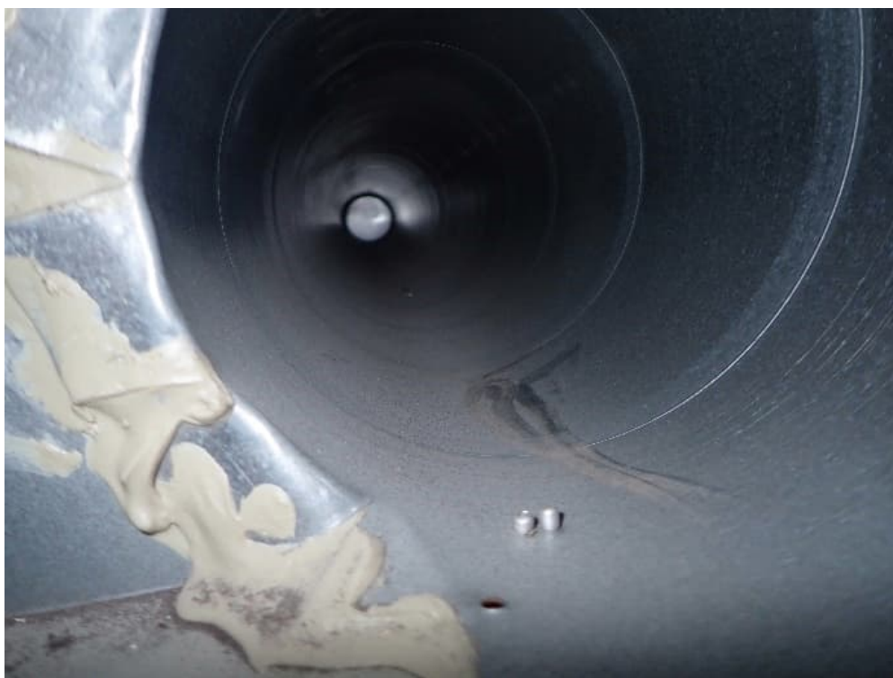
Kuva 71. Tuloilmakanavistossa havaittiin pölykertymää.
