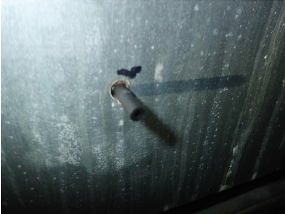
Kuva 58. Tuloilmakoneen suodatinkammiossa havaittiin tiivistämätön anturiläpivienti, jossa on suojaamatonta mineraalivillaa.
