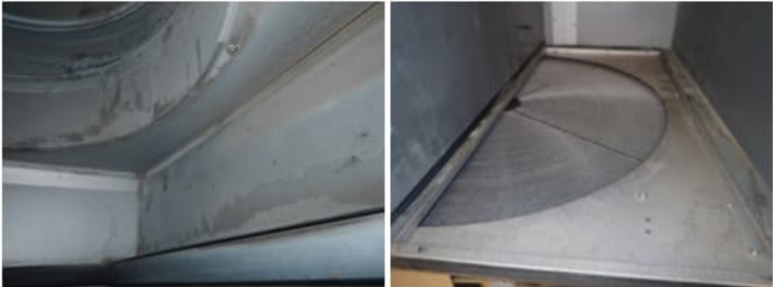
Kuva 61. Tuloilmakoneen suodatinkammiossa havaittiin vanhoja kosteusjälkiä, kuolleita hyönteisiä, siitepölyä ja pölyä
