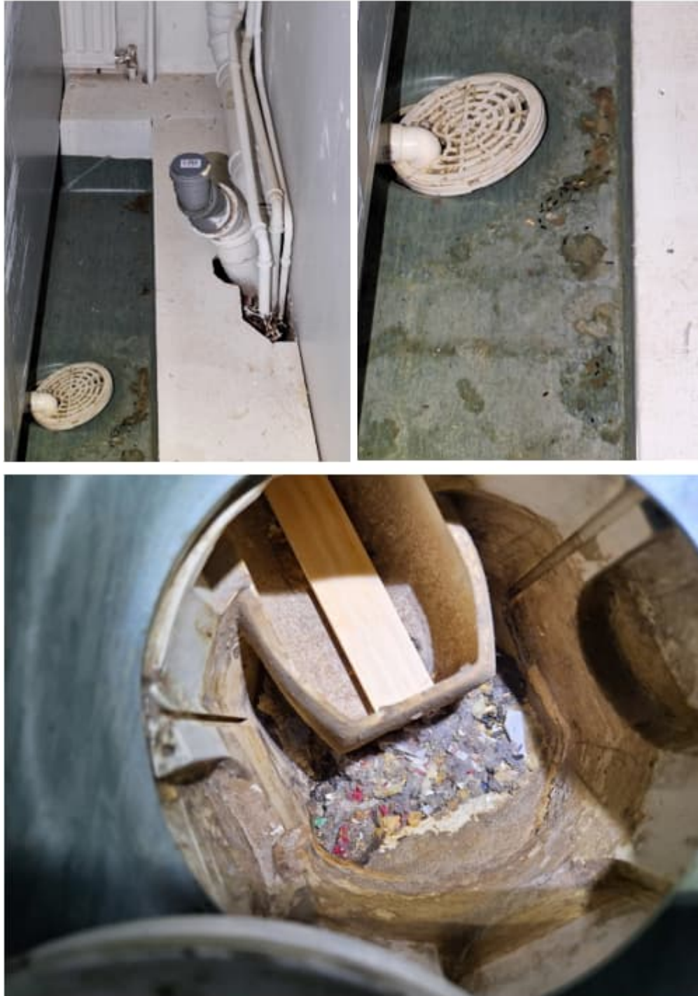
Kuva 15. IV-konehuoneen 114P lattialla havaittiin epätiiviyttä läpivientejä alapohjarakenteisiin, sekä runsaasti hiirien eritteitä sekä likaa. Lattiakaivo
