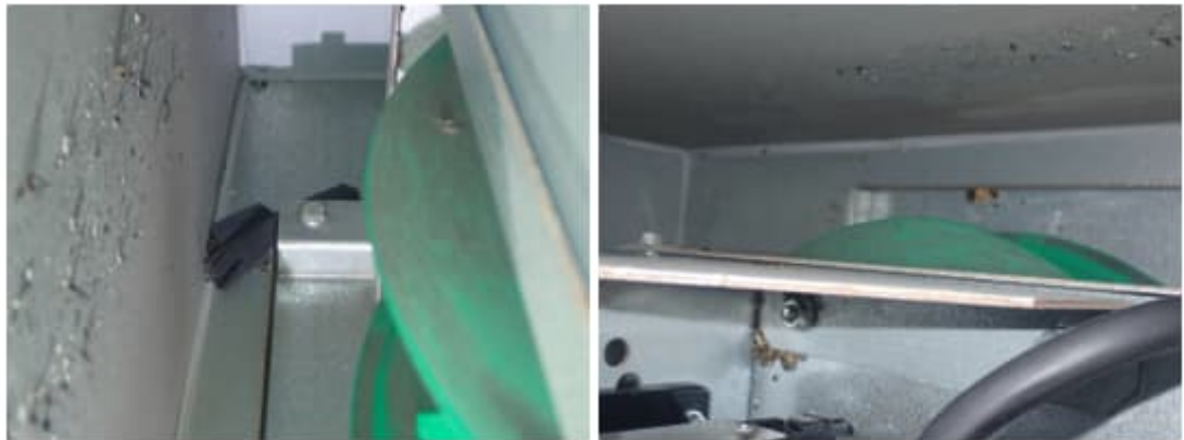
Kuva 66. Poistoilmakoneen puhallinkammiossa havaittiin roskaa, siitepölyä ja likaa.
