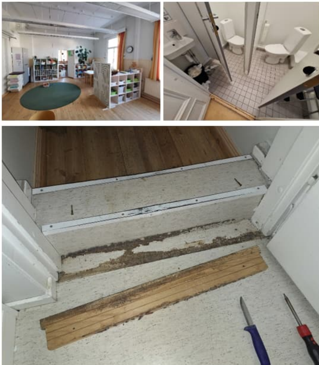
Kuva 8. Lakattu ponttilautalattia sekä wc-tilojen keraamiset laatat olivat havaintojen mukaan pääosin hyvässä kunnossa. Lautalattia ja puiset kynnykset ovat kuitenkin kuluneita sisäänkäyntien ja ovien edustoilta. Puisten kynnysten alustat ovat lisäksi melko likaisia.
