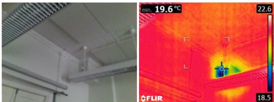
Kuva 78. Käytöstä poistettu poistoilmaventtiili huonetilassa 106 p.
