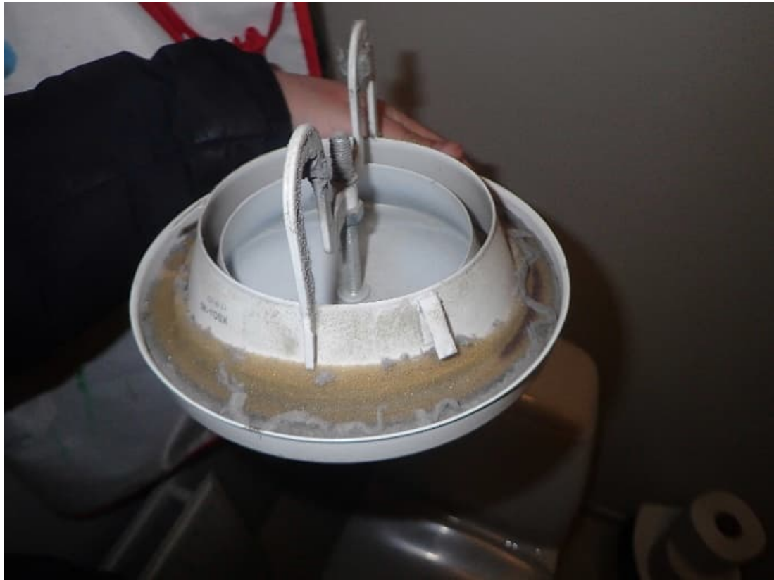
Kuva 77. Poistoilmapäätelaitteissa havaittiin pölykertymää.
