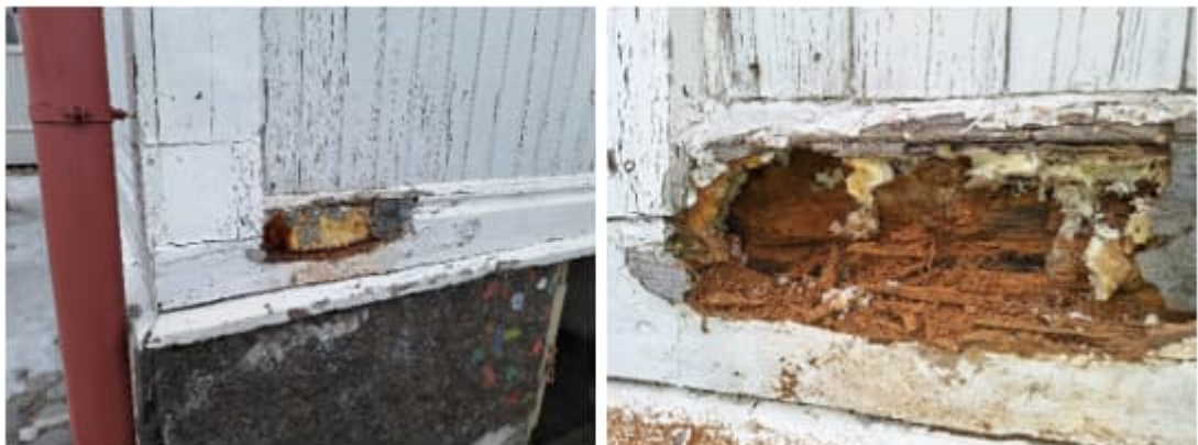
Kuva 27. Rakennuksen kaakon- ja lounaanpuoleisilla nurkkauksilla, julkisivun puurakenteet sekä alin hirsi ovat lahovaurioituneet paikallisesti
