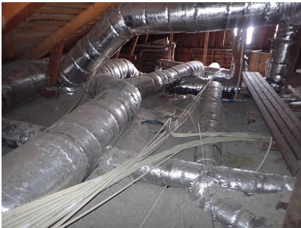
Kuva 70. Yleiskuva ullakkotiloissa kulkevista ilmanvaihtokanavista.
