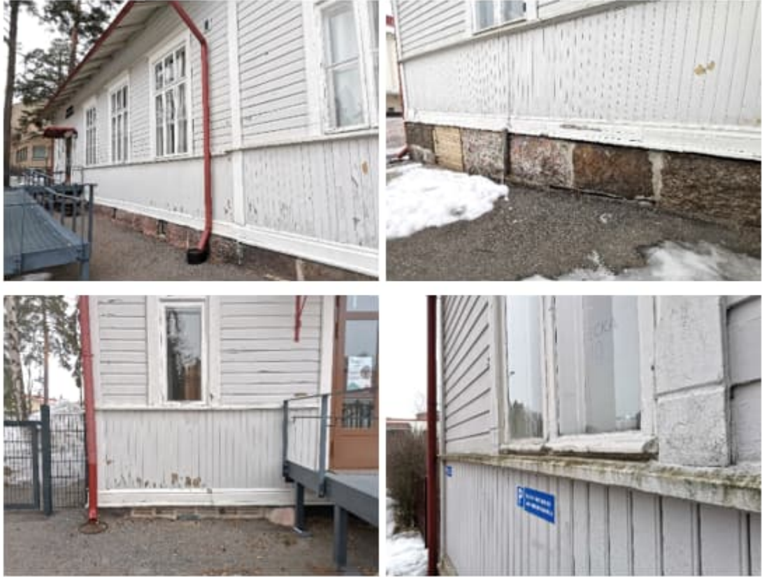
Kuva 26. Julkisivun paneloinnissa rakennuksen itä- ja länsisivuilla on havaittavissa maalipinnan hilseilyä. Rakennuksen pohjoissivu on selvästi muuta julkisivua likaisempi ja vaakapinnoilla kasvaa sammalta.
