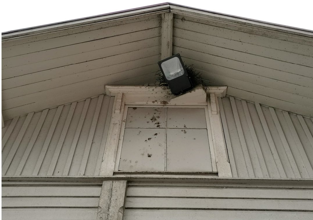
Kuva 25. Ulkoseinien yläosassa, räystäiden alla havaittiin kahdessa kohdassa linnunpesät. Myös julkisivussa on näiltä osin linnun ulostetta.
