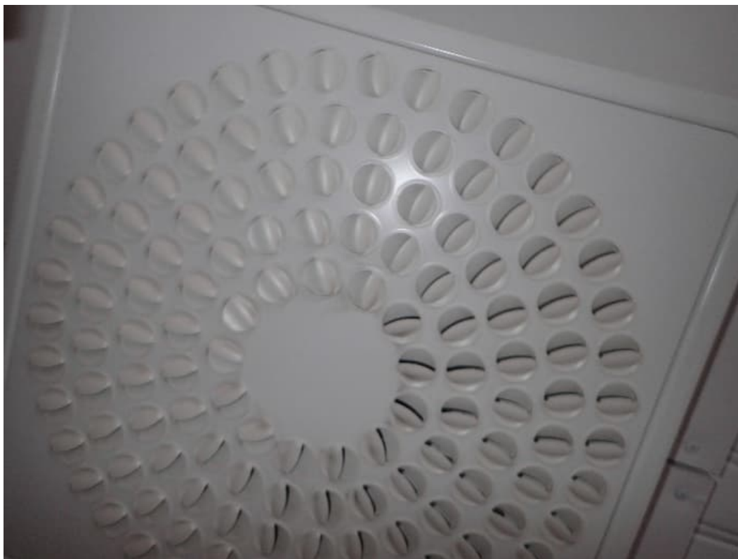
Kuva 73. Yleiskuva perusparannuksen yhteydessä vuonna 2014 asennetusta kattomallisesta tuloilmapäätelaitteesta.
