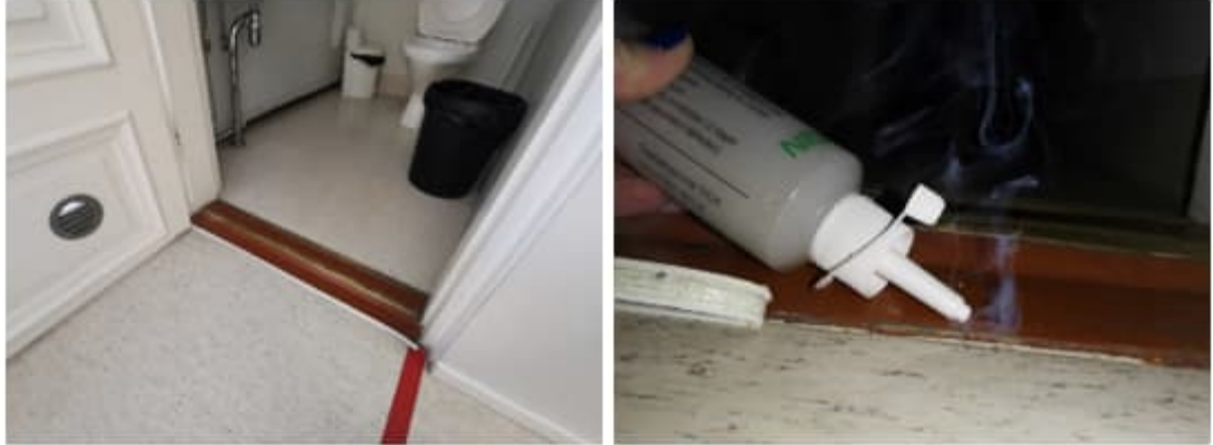
Kuva 13. Tilojen 109P-112P kynnyksiin on asennettu ikkunoihin ja oviin tarkoitettu tiivistysnauha, joka jättää rakoja liittymään sekä kiinnittyy heikosti alustaan. Liittymästä havaittiin voimakkaitakin ilmavirtauksia käyttötiloihin.
