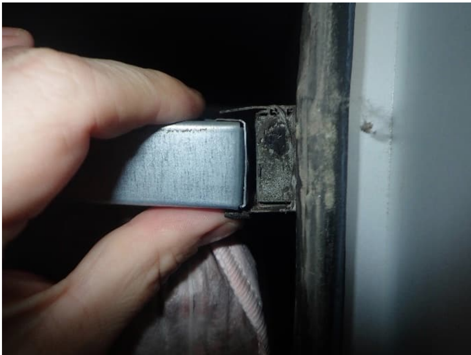
Kuva 59. Tuloilmakoneen suodatinkehikon ja suodattimien välinen tiiveys on puutteellista ja siitä aiheutuu ohivirtausta.
