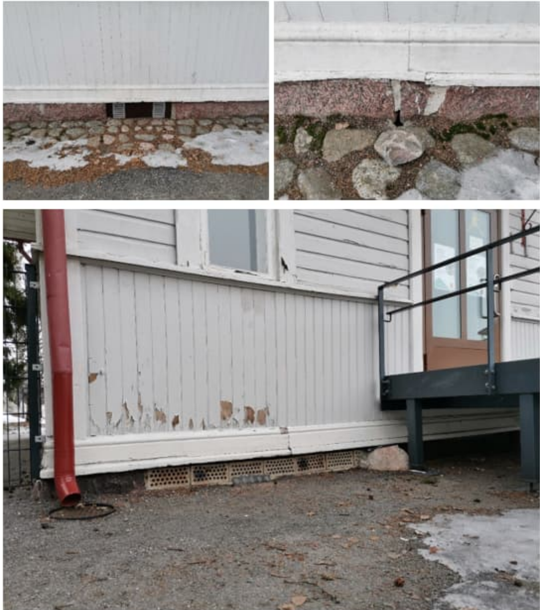
Kuva 22. Rakennuksessa on tuuletusluukuilla varustetut luonnonkiviperustukset, joiden laastisaumauksissa havaittiin paikoin rakoilua. Kirjaston päädyssä on lisäksi reikätiilillä paikattu alue.
