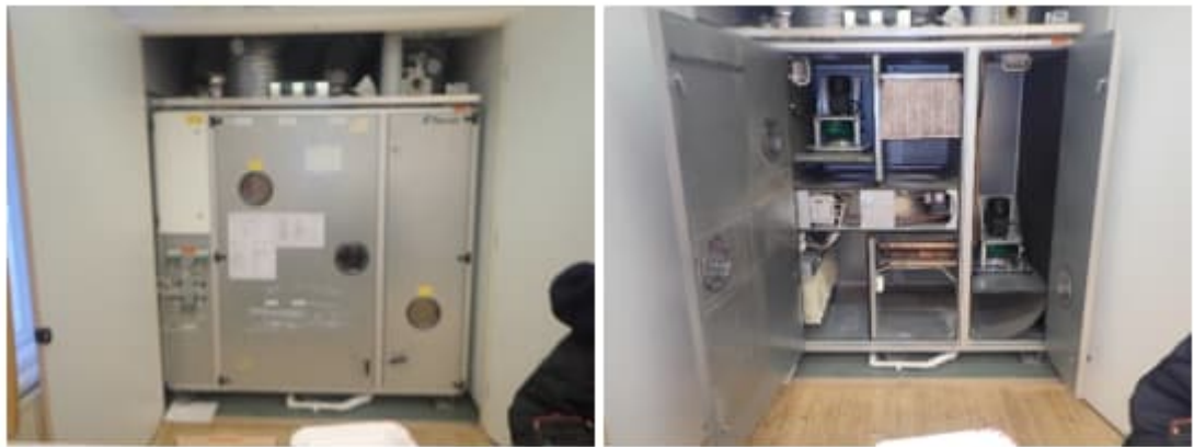
Kuva 57. Yleiskuvat ilmanvaihtokoneesta TK/PK12.
