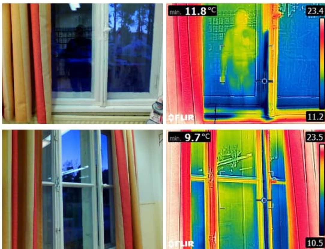
Kuva 33. Ikkunoiden liittymät eivät ole lämpökameralla ja aistinvaraisesti tarkasteltuna tiiviitä. Auki jäävät sisäpuutteet päästävät kylmää ilmaa merkittävästi sisään.
