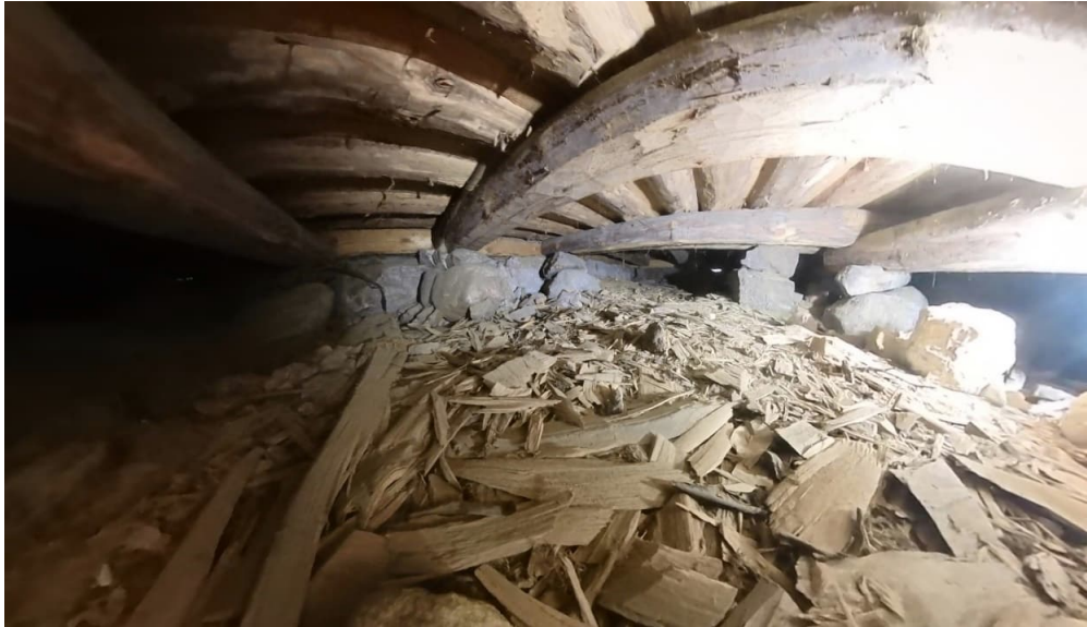
Kuva 18. Kuvassa olevaa höylättyä puusilppua havaittiin runsaasti tilan 106 p alla, tällä alueella alapohjatilassa lisäksi selvä maakellarimainen haju muihin ryömintätilan osiin verrattuna.
