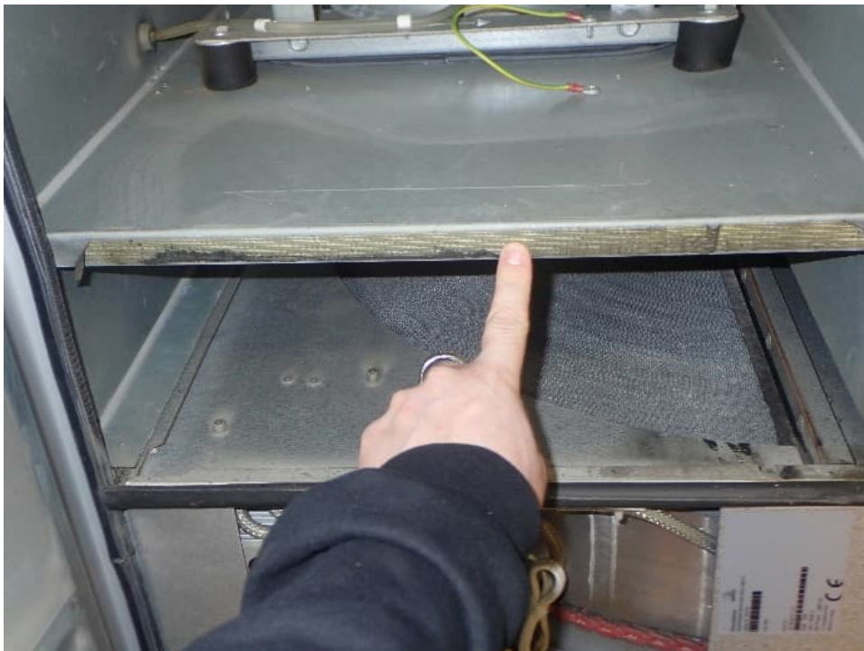
Kuva 65. Poistoilmakoneen puhallinkammion ja tarkastusluukun/oven välinen tiiviste puuttuu kokonaan.
