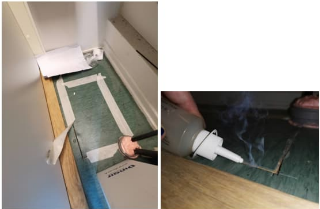
Kuva 14. Tilan 114P sähkökaapin putkiläpivienti on tiivistetty uretaanivaahdolla ja on näiltä osin tiivis. Kuitenkin lattiassa oleva sahattu
