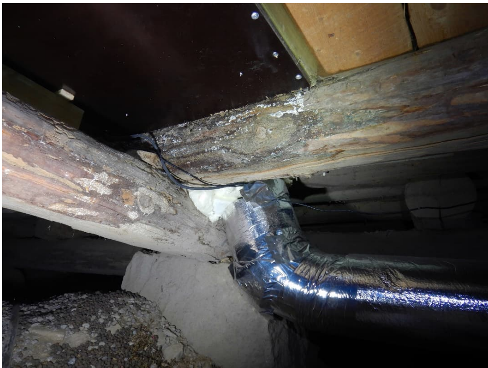
Kuva 19. Vanha kosteusvaurio havaittiin wc-tilojen 107 p alapohjarakenteissa läpiviennin kohdalla. Puu itsessään on kovaa ja aktiivista vuotoa ei todettu.
