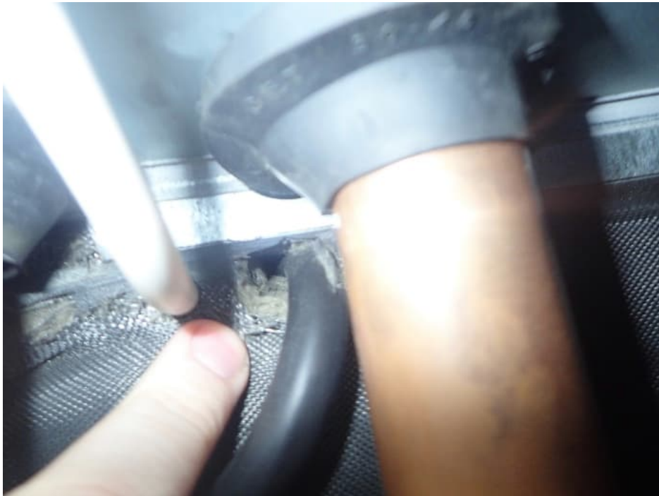
Kuva 64. Tuloilmakoneen puhallinkammiossa havaittiin anturiläpivientejä, joissa on suojaamatonta mineraalivillaa.
