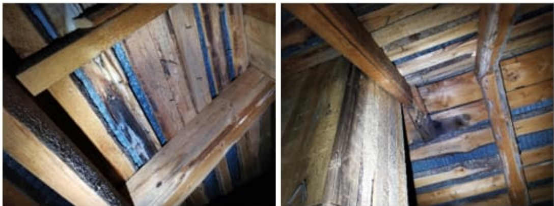
Kuva 46. Yksittäisiä paikallisia kosteusvaurioituneita ruodelautoja havaittiin laajennusosan vanhan hormin edustalla, sekä vanhalla osalla kattoluukun läheisyydestä.
