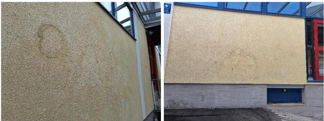
Kuva 8. Muutamissa kohdissa rakennuksen rappauspinnasta on poistettu spraymaalauksia, ja näissä kohdissa rappauspinta on kulunut.
