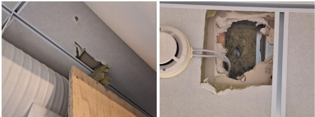
Kuva 36. Näyttelyjen rakennustilan 0104 akustiikkalevytys on rikki paikoittain. Yhdessä kohdassa katon akustiikkalevytystä on avattu ja takana on kaksinkertainen kipsilevytys, jonka yläpuolella on mineraalivillaa, jonka läpi näkyy välipohjan betonipinta.
