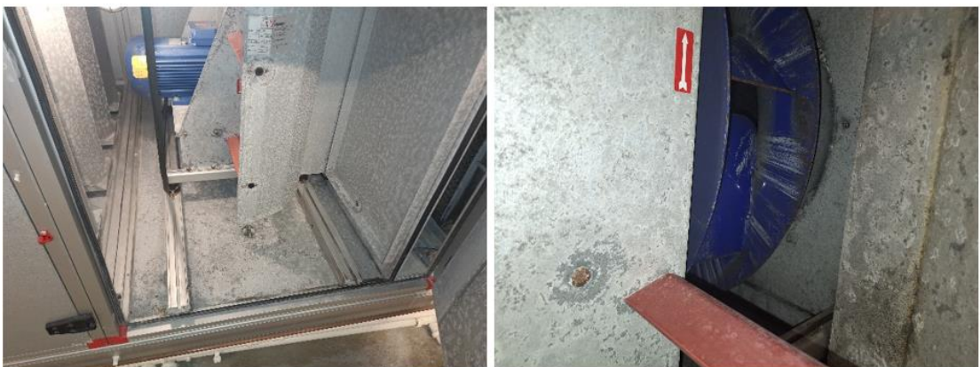
Kuva 63. Yleiskuvat tuloilmapuhallinkammioista. Kammiossa on vaurioita ja korroosiojälkiä.
