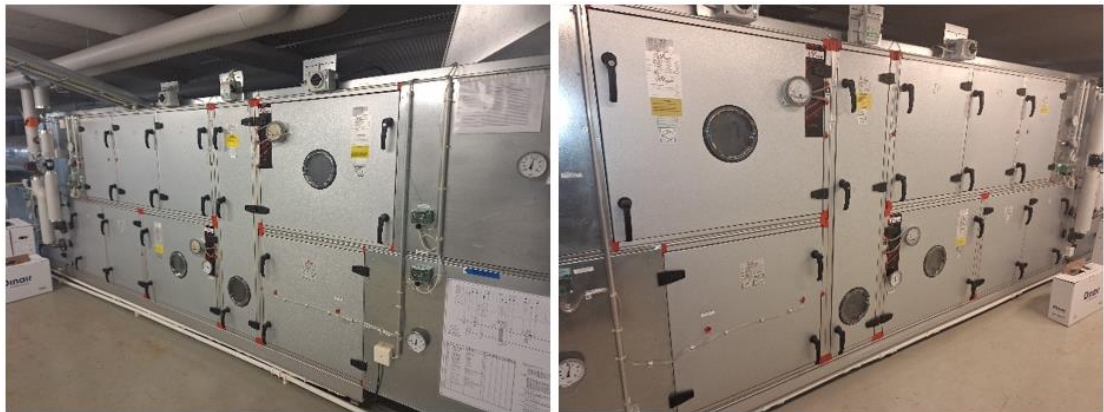
Kuva 51. Yleiskuvat ilmanvaihtokoneista. Vasemmanpuoleisessa kuvassa IV-kone TK04 ja oikeanpuoleisessa kuvassa IV-kone TK02.
