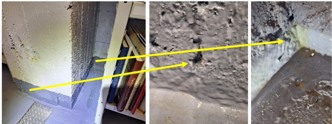
Kuva 42. Pilarin juuresta havaittiin kohtalaista pistemäistä ilmavuotoa kahdesta reiästä.
