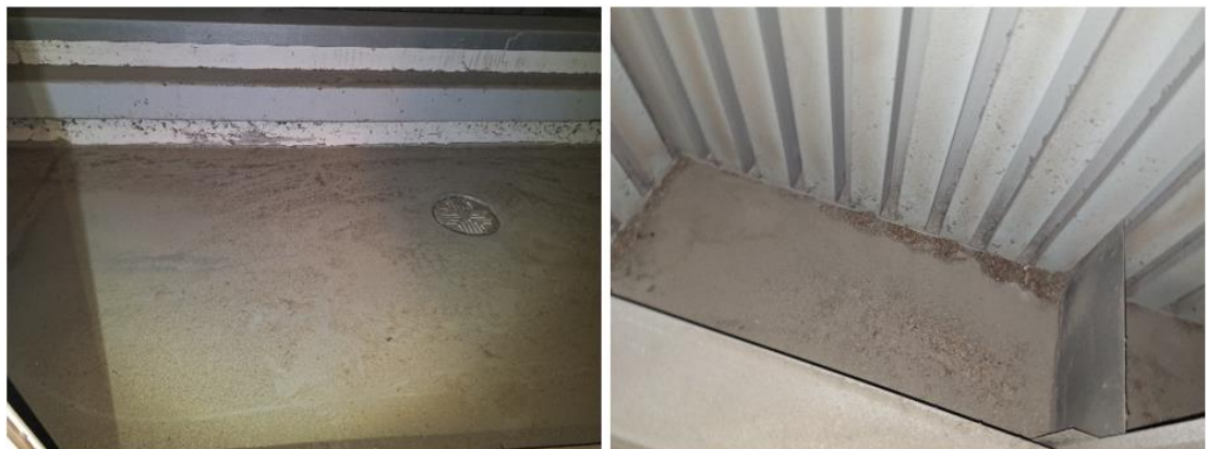
Kuva 59. Yleiskuva tuloilmakammioista. Kammion pohjalla on runsaasti likaa sekä hyönteisiä.
