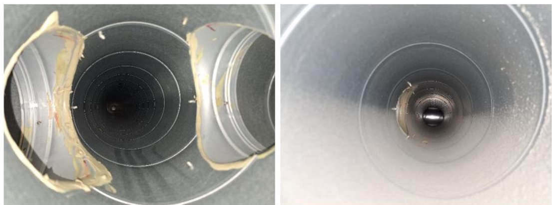
Kuva 68. Tulo- sekä poistoilmakanavistossa havaittiin pölykertymää. Vasemmanpuoleisessa kuvassa on tuloilmakanava ja oikeanpuoleisessa kuvassa on poistoilmakanava.
