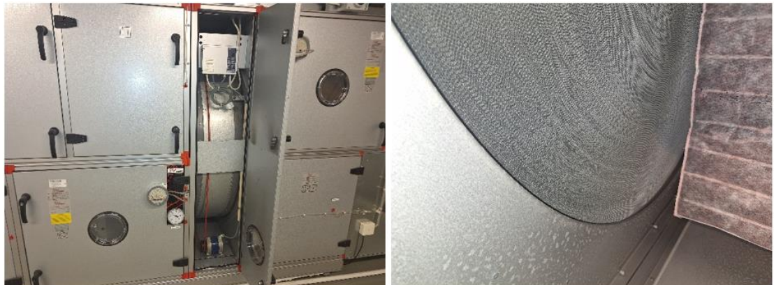
Kuvat 55. Yleiskuvat ilmanvaihtokoneiden LTO-osista. Kammioiden pohjalla havaittiin hieman pölyä.
