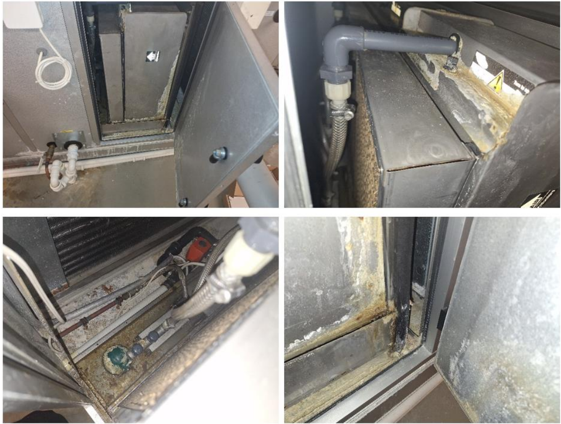
Kuvat 62. Yleiskuvat ilmanvaihtokoneen kostutusosasta. Kammion sisäosissa havaittiin runsaasti epäpuhtauksia sekä korroosio- ja kosteusjälkiä.
