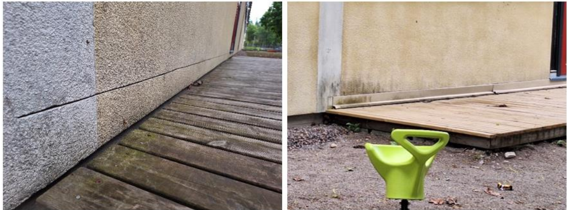
Kuva 10. Rakennukseen on paikoin tehty terassirakenteita. Toisesta kuvan terassirakenteesta (vasen) puuttuu liitokseen tehty pellitys ja pellin asennusura on avoinna.
