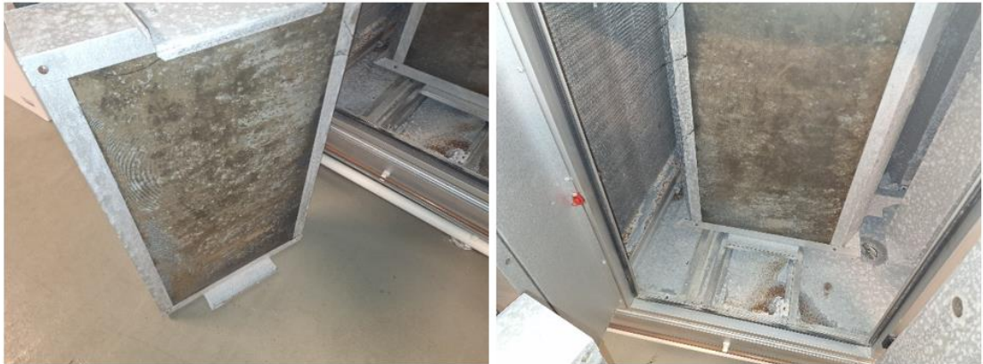
Kuva 64. Yleiskuvat äänenvaimennusosista. Kammion pohjalla on korroosion ja kosteuden jälkiä. Äänenvaimennusosissa on runsaasti kosteusjälkiä.
