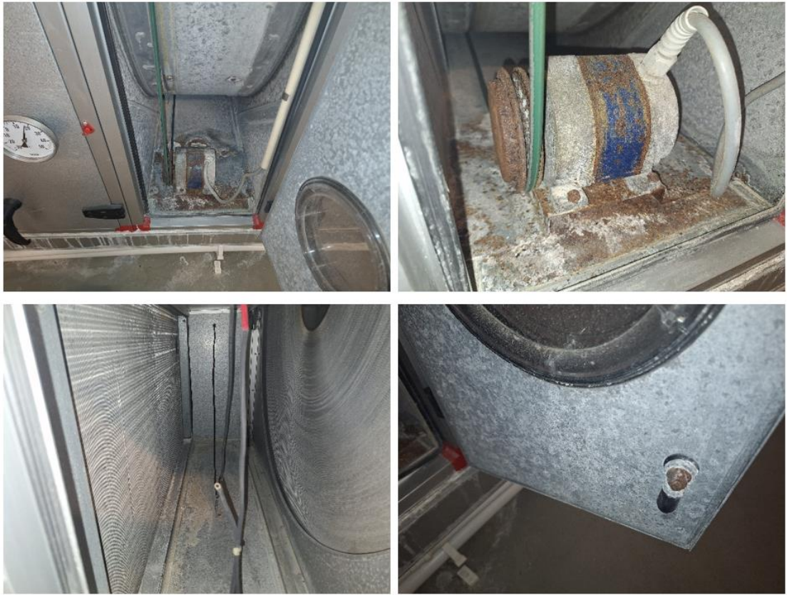
Kuvat 61. Yleiskuvat ilmanvaihtokoneen LTO-osasta, kuivatuspatterista sekä LTO-osan tarkastusluukusta. LTO-osat, kammion pohja, tarkastusluukku ja patteri ovat korroosiovaurioituneet ja niissä on ruostetta. Kammion pohjalla havaittiin edellä mainittujen lisäksi kosteusjälkiä. LTO- osalla ei havaittu viemäröintiä.
