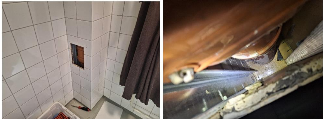
Kuva 19. Suihkutilan 0114 nurkan putkikotelon pohjalla havaittiin vettä. Selvää vuotokohtaa putkesta ei havaittu.
