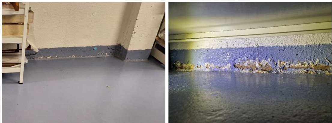
Kuva 28. Varastotilojen 0205 ja 0206 lattia-seinäliitoksia ei ole tiivistetty. Varastojen betonirakenteisten seinien maali hilseilee liitosten kohdilla, ja suoloja on puskenut betonin pintaan. Maalin hilseilyä havaittiin pääasiassa vain maanvastaisten seinien alueilla, joissa lattia-seinäliitosta ei ole tiivistetty. Ei poikkeavia hajuja.
