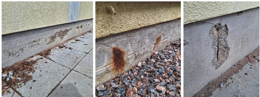
Kuva 6. Rakennuksen sokkelirakenteissa oli havaittavissa maalipinnan hilseilyä ja paikoittain ruostejälkiä tai kohtia, joissa pintabetoni on haljennut irti pinnasta raudoituksen kohdalla.
