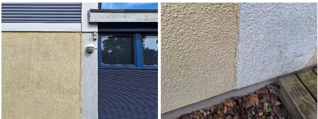
Kuva 9. Julkisivurappaus on halkeillut joistakin kohdista paikallisesti.
