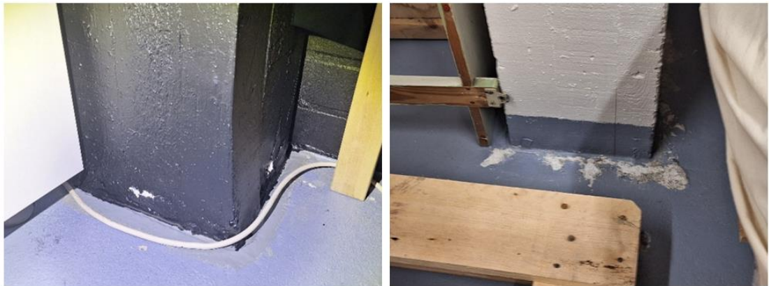
Kuva 16. Varaston 0201 ja työtilan 0111 yhden betonipilarin kohdalla TKR-pinnoite on irronnut lattia-pilariliitoksessa paikallisesti pohjastaan ja alla on havaittavissa suolakidekertymää. Ei poikkeavia hajuja.
