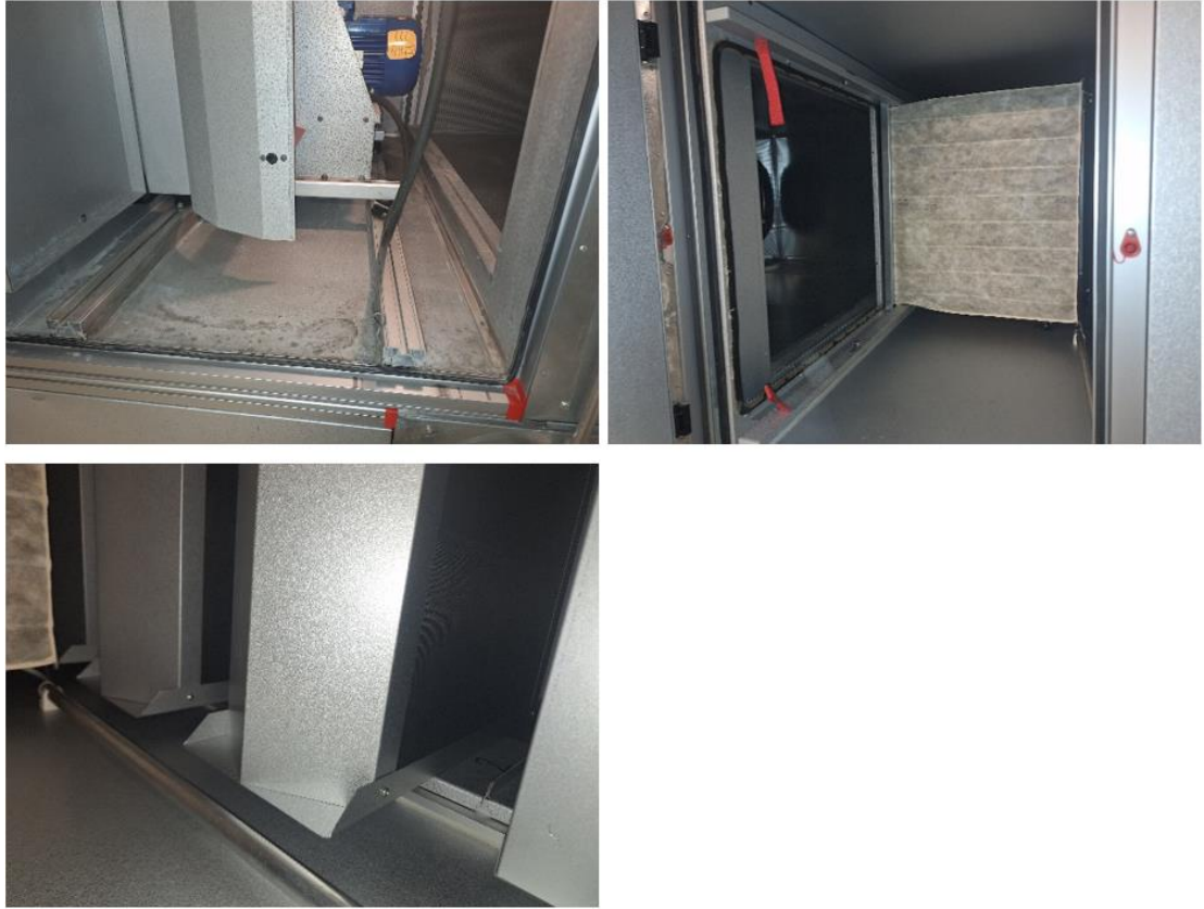
Kuva 66. Yleiskuvat poistoilmapuolen sisäosista. Poistoilmapuhaltimen kammion pohjalla on hieman kosteuden jälkiä. Muut sisäosat ovat hieman pölyn peitossa. Sisäosissa ei havaittu korroosiovaurioita.
