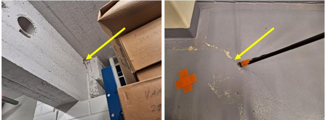
Kuva 39. Palkin vanhan läpiviennin kautta havaittiin voimakasta ilmavuotoa (vasen). Lattian halkeaman kautta havaittiin voimakasta viivamaista ilmavuotoa (oikea).
