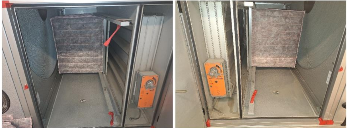
Kuva 54. Yleiskuvat tuloilmasuodatinkammiosta. Kammioiden pohjalla on hieman pölyä ja jälkiä seisoneesta vedestä sekä suodatinrunkojen tiivisteet ovat heikossa kunnossa.
