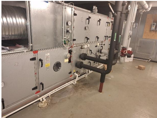
Kuva 58. Yleiskuva TK08 ilmanvaihtokoneesta. Ilmanvaihtokoneen alla on runsaasti kosteusjälkiä. Koneen rungossa on valuma- sekä korroosiojälkiä.
