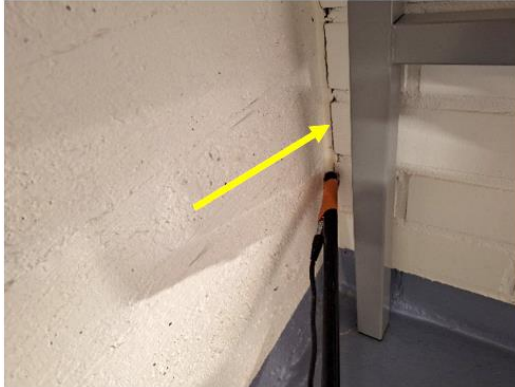
Kuva 43. Kantavan betonisen väliseinän ja muuratun väliseinän liitoksesta havaittiin voimakasta viivamaista ilmavuotoa.
