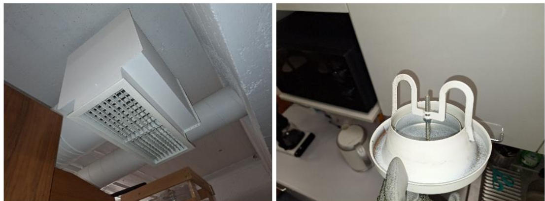
Kuva 70. Yleiskuvat poistoilmapäätelaitteista. Päätelaitteissa havaittiin jonkin verran pölynkertymää.
