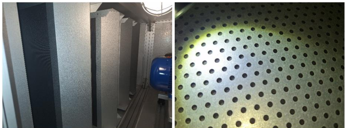
Kuva 57. Yleiskuvat ilmanvaihtokoneiden äänenvaimennusosista. Äänenvaimennusosat on päällystetty suojaavalla lasikuitukankaalla.
