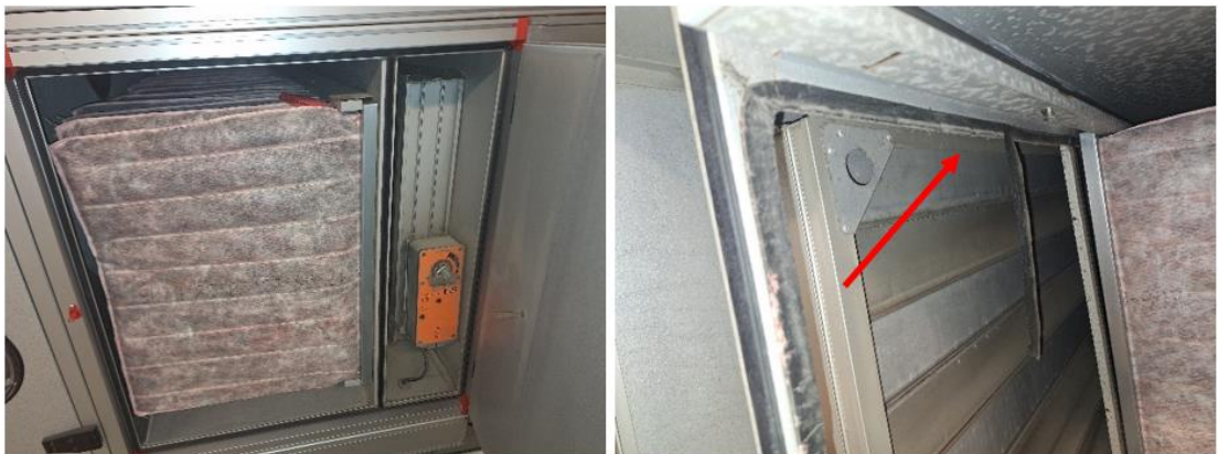
Kuva 53. Yleiskuvat tuloilmasuodatinkammiosta. Suodattimien tiivistenauhat ovat paikoin rikki, minkä takia suodattimet eivät tiivisty tiiviisti suodatinrunkoihin nähden. Silmämääräisten arvioiden perusteella, suodattimien ohivuotoa esiintyy jonkin verran.
