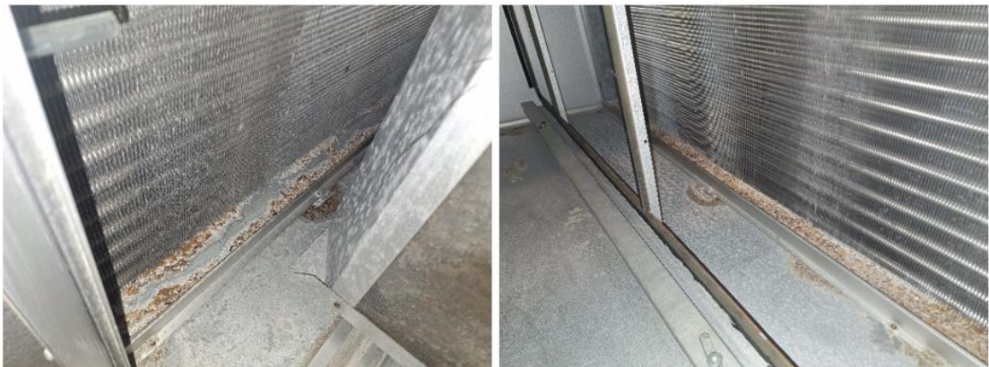
Kuva 65. Yleiskuvat jälkilämmityspatterista. Patterissa sekä kammion pohjalla korroosiovaurioita ja ruostetta.
