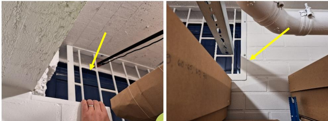
Kuva 40. Savunpoistoluukun liitosten kautta havaittiin kohtalaista viivamaista ilmavuotoa.
