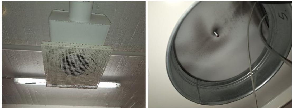
Kuva 69. Yleiskuva tuloilmapäätelaitteesta. Päätelaitteen äänenvaimennusmateriaalina on käytetty polyesterimateriaalia. Päätelaitteissa havaittiin hieman pölynkertymää.
