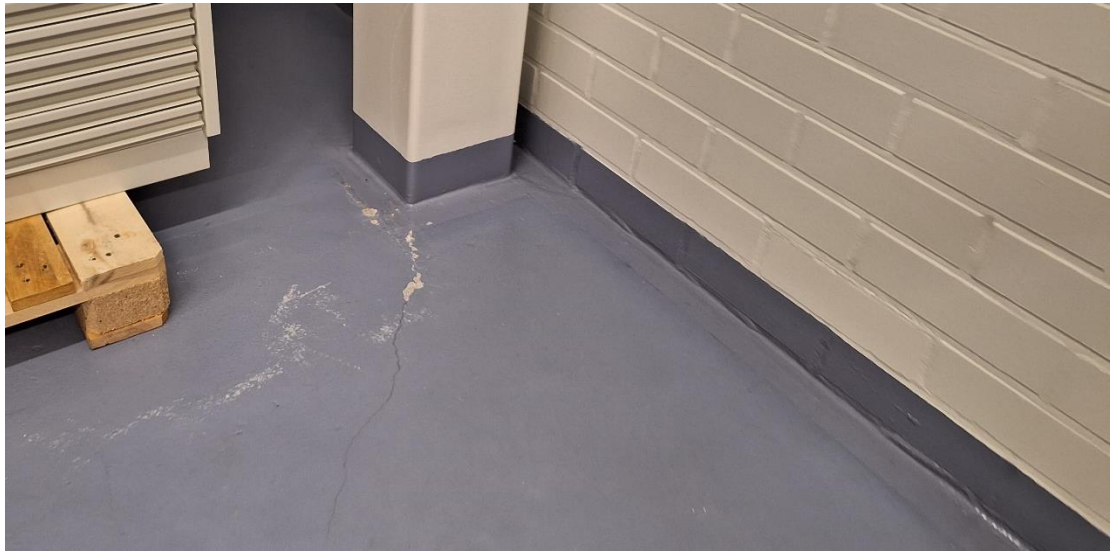
Kuva 15. Varaston 0204 uuden teräspilarin ympärillä lattiapinnassa TKR-pinnoite on irronnut vähäisesti pohjastaan. Betonilaatta on haljennut pilarin kulmasta lähtien ja halkeaman ympärillä havaittiin kohonneita pintakosteusilmaisimen lukemia.
