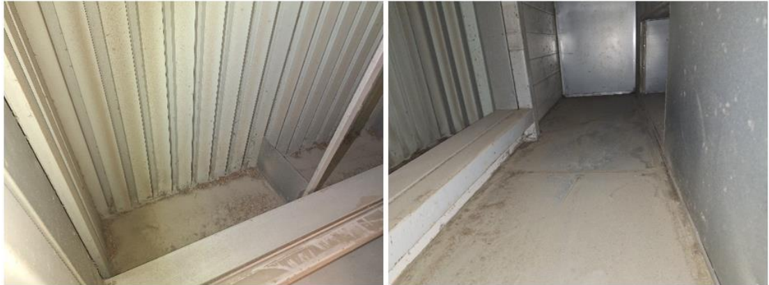
Kuva 52. Yleiskuva ilmanvaihtokoneiden tuloilmakammioista. Kammion pohjalla on hieman kosteusjälkiä ja runsaasti likaa sekä hyönteisiä.
