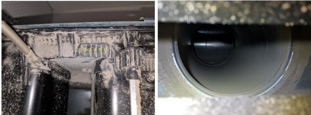
Kuva 29. Luokkatilojen poistoilman päätelaitteissa on runsasta pölykertymää.
