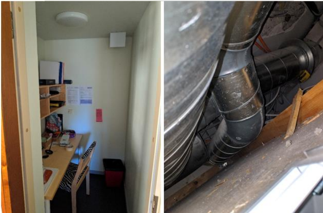
Kuva 35. Opettajienhuoneen yhteydessä olevassa puhelinkopissa ei havaittu ilmanvaihtolaitteita. Tilan ilman laatu on tunkkainen. Kopin alakaton yläpuolella kulkee tulo- ja poistokanavarunko.
