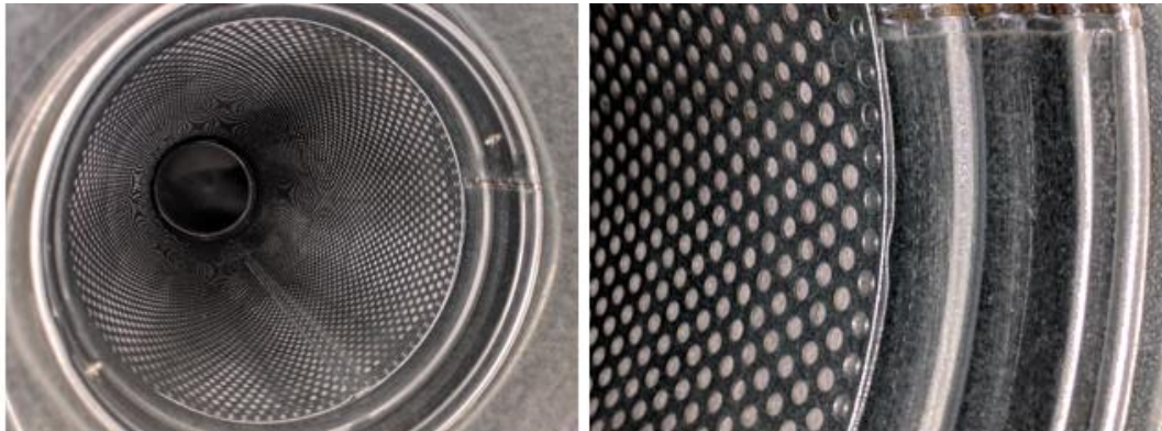
Kuva 31. Luokkatilojen äänenvaimennin, jonka vaimennusmateriaalina käytetty synteettistä eristettä. Äänenvaimentimet ovat hyväkuntoiset.
