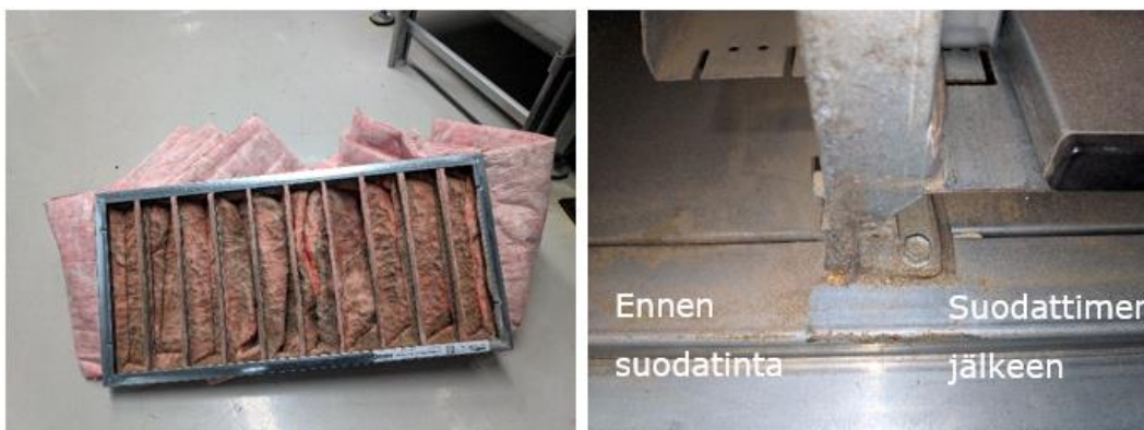
Kuva 5. Ilmanvaihtokoneen tuloilmasuodatin. Tuloilmasuodattimet tiivistyvät konerunkoon ja niissä ei havaittu merkittävää ohivuotoa. Suodattimet on vaihdettu viimeksi 05.03.2024.
