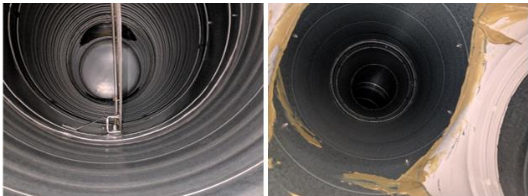
Kuva 28. Yleiskuvat tuloilman runkokanavasta ja palopellistä, sekä tuloilman kytkentäkanavasta. Pölykertymän arvio alle 0,2 g/m 2 . Kanavan liitoksissa näkyy ilmanvaihtokanavien liitosten tiivistyksessä käytettyä massaa.
