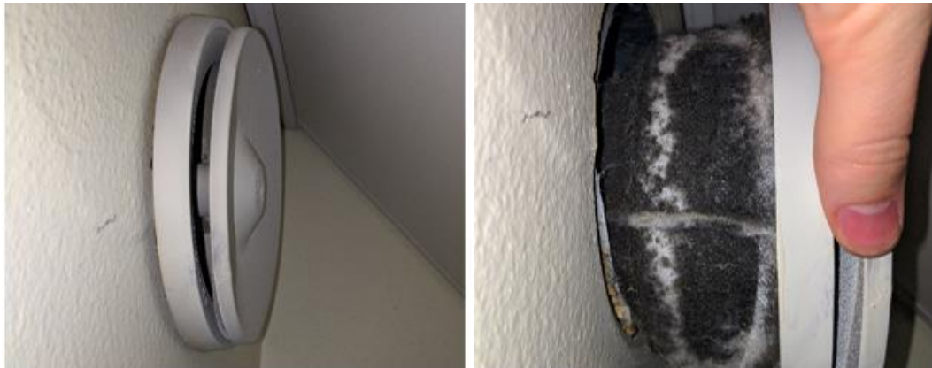
Kuva 38. Tilan 118 raitisilmaventtiilin suodatin on likainen ja läpivienti ei ole täysin tiivis.
