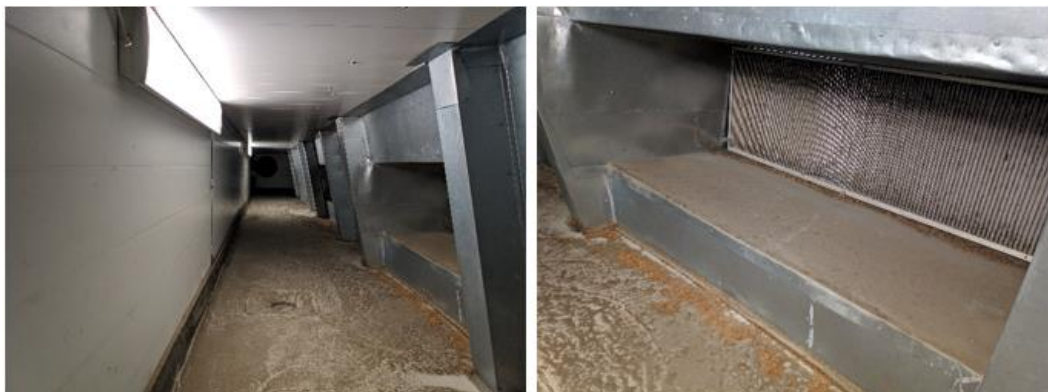
Kuva 3. Rakennuksen keskiosan ilmanvaihtokonehuoneen yhteinen raitisilmakammio. Raitisilmakammio ja raitisilmasäleiköt ovat likaiset.
