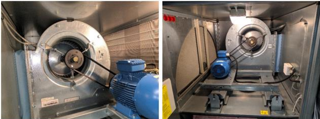
Kuva 15. Ilmanvaihtokoneen tulo- ja poistopuhaltimet. Puhallinkammioiden pohjalla mahdollisesti hihnasta tai hihnapyörästä kulunutta purua.
