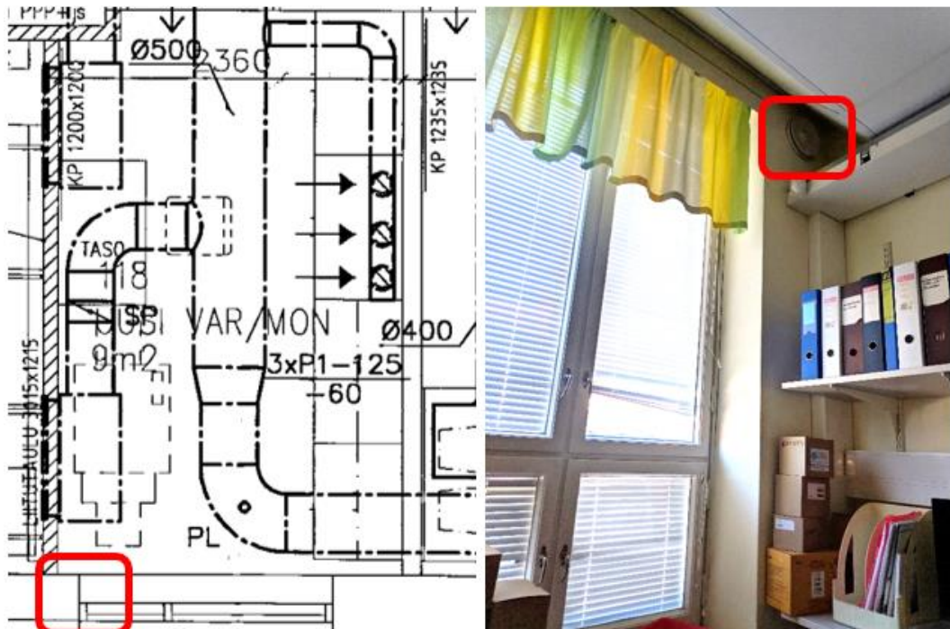
Kuva 37. Tilaan 118 on raitisilmaventtiili ulkoseinässä. Suunnitelmien mukaan tilassa on vain poistoilmanvaihto ja korvausilma tulee siirtoilmana käytävältä.
