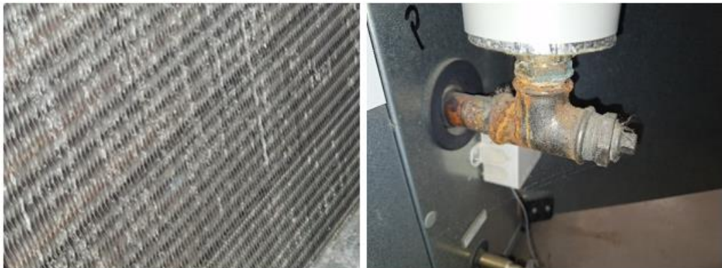
Kuva 20. Lämmityspatterin lamellit ovat pölyiset. Patterin paluuliittimessä on pintaruostetta ja vanhoja vuotojälkiä.
