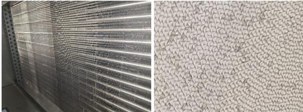
Kuva 10. Lämmityspatteri on yleiskunnoltaan siisti, lamellit ovat osin taipuneet. Lämmöntalteenotto-roottorin lamelleissa on pölyä
