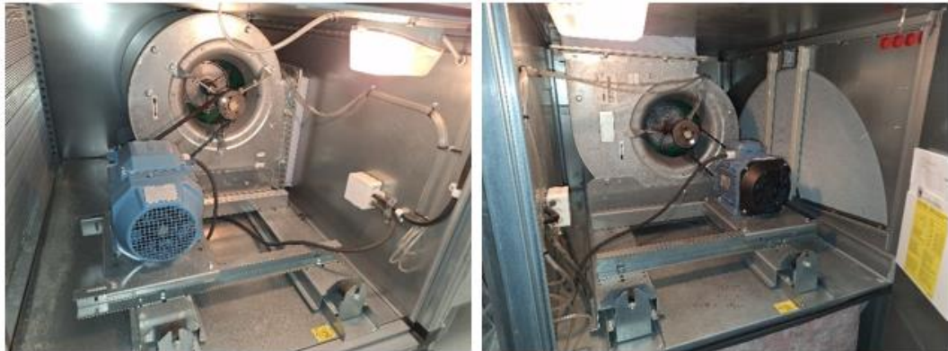
Kuva 21. Ilmanvaihtokoneen tulo- ja poistopuhaltimet.
