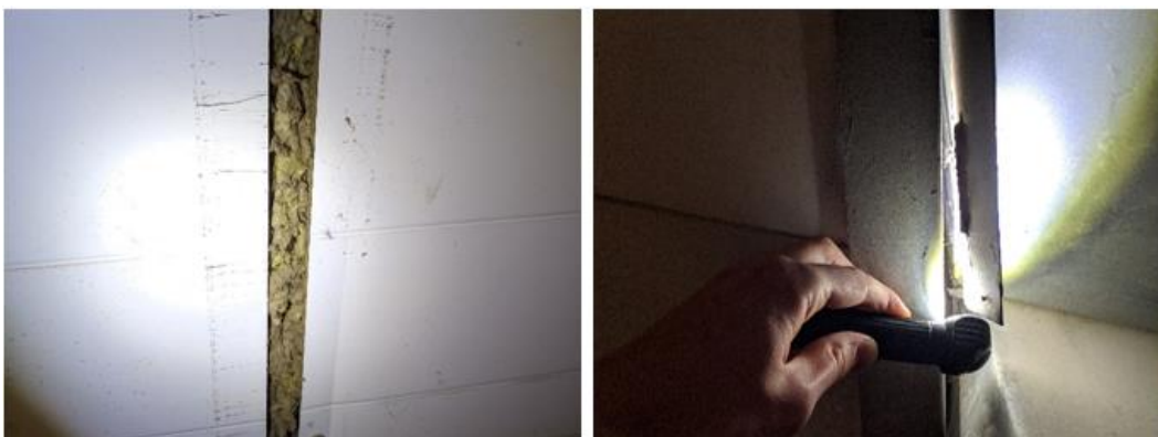
Kuva 4. Raitisilmakammion sisäseinissä on avoimia villapintoja. Rakenteiden liittymät ovat epätiivittä ja kammiosta on ilmayhteyksiä seinärakenteisiin.
