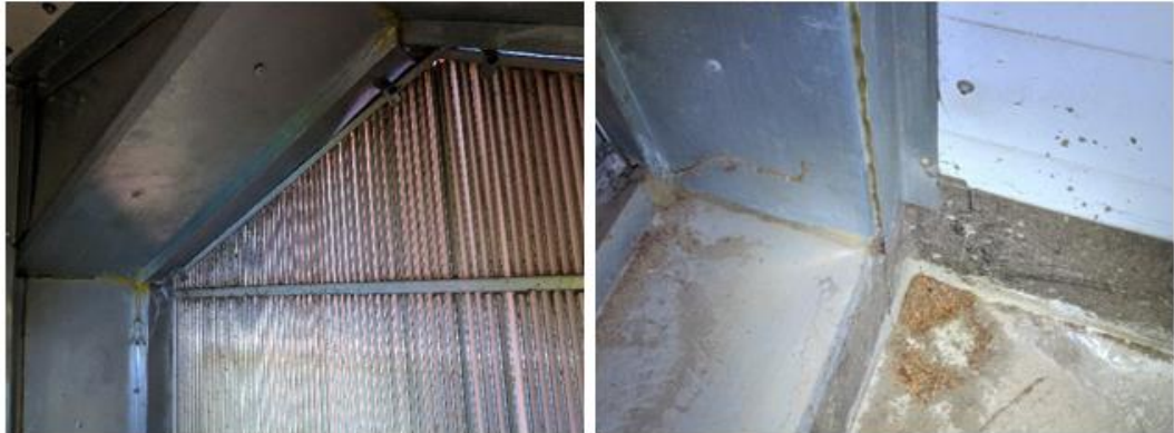
Kuva 18. Raitisilmasäleikkö ja kammio on likainen. Seinien ja lattian liitokset on tiivistetty massalla.
