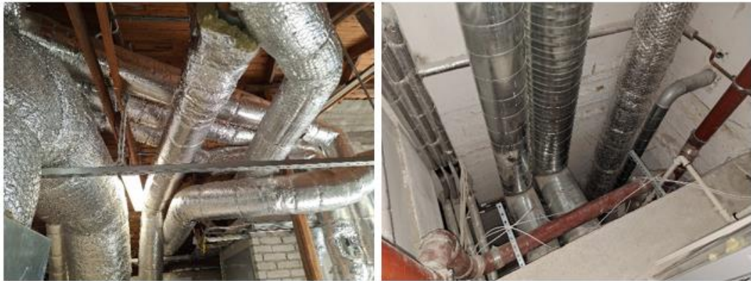
Kuva 27. Yleiskuvat ilmanvaihtokanavistosta ullakkotilassa, sekä pystynousuista tekniikkakuiluissa.
