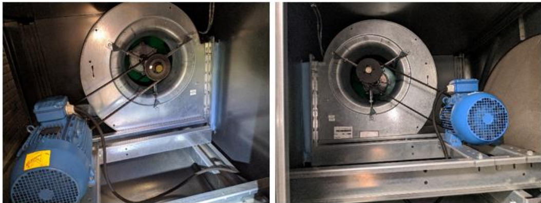
Kuva 7. Ilmanvaihtokoneen tulo- ja poistopuhaltimet.
