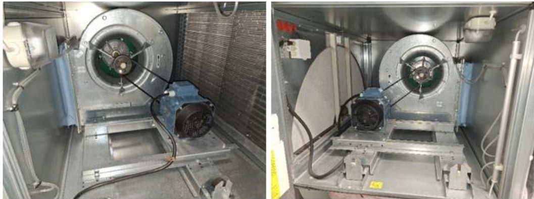
Kuva 11. Ilmanvaihtokoneen tulo- ja poistopuhaltimet. Puhallinkammioiden pohjalla mahdollisesti hihnasta tai hihnapyörästä kulunutta purua.
