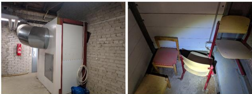
Kuva 17. Ilmanvaihtokoneen raitisilmakammio. Raitisilmakammion sisällä on varastoituna tuoleja.
