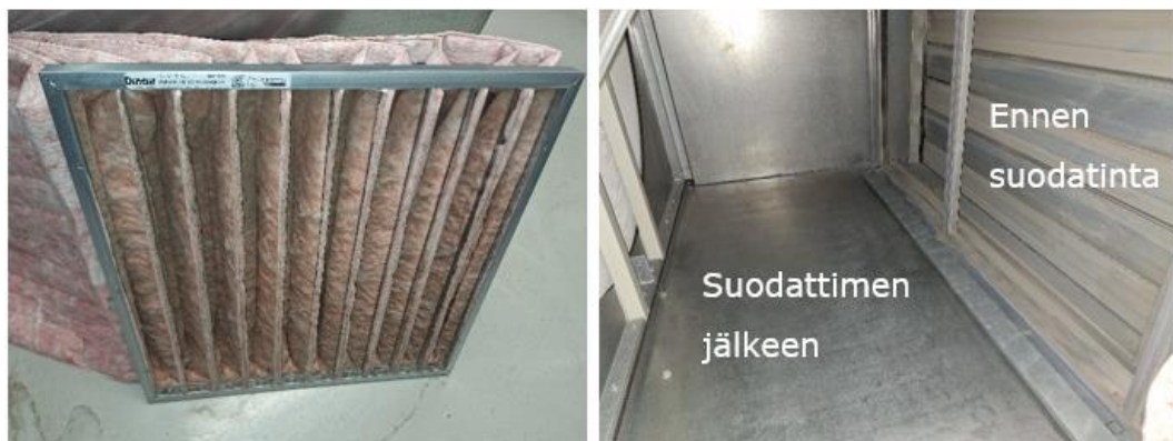
Kuva 9. Ilmanvaihtokoneen tuloilmasuodatin. Tuloilmasuodattimet tiivistyvät konerunkoon ja niissä ei havaittu merkittävää ohivuotoa. Ilmanvaihtokoneen sisäosat ovat siistit. Suodattimet on vaihdettu viimeksi 05.03.2024.
