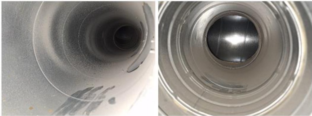
Kuva 30. Poistoilmakanavistossa on pölykertymää, arvio yli 1 g/m 2 .
