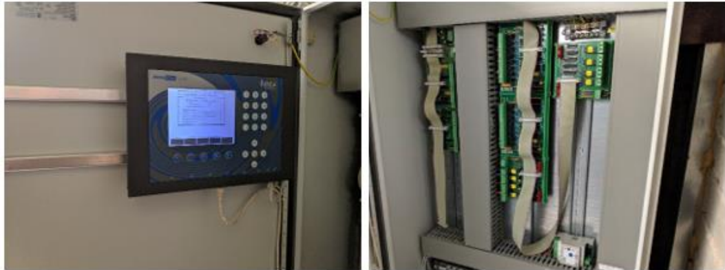
Kuva 43 Automaatiojärjestelmän alakeskuksen keskusyksikkö (vasemmalla), sekä automaatiomodulit (oikealla).
