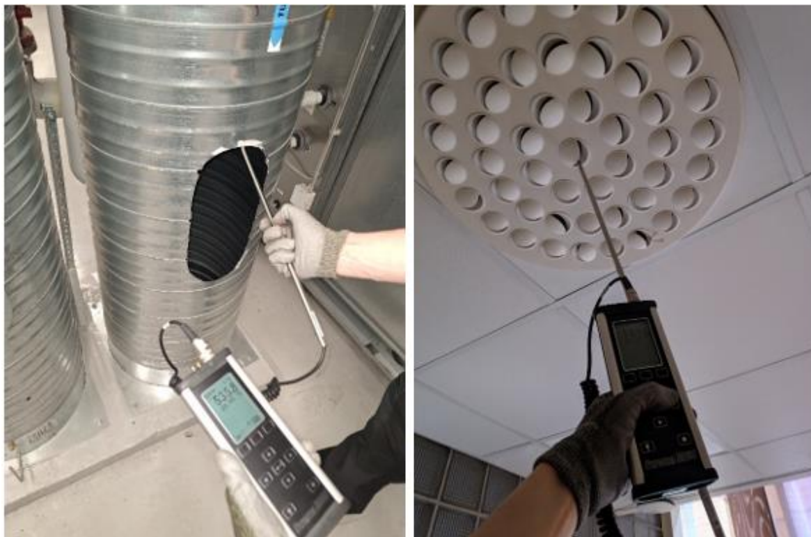
Kuva 41. Tuloilman lämpötilan tarkistusmittaukset konehuoneen kanavasta ja huonetilojen tuloilmapäätelaitteelta. Mitatut lämpötilat vastasivat rakennusautomaation alakeskukselta luettuja ilmanvaihtokoneiden anturien lukemia (n. 23–24 °C).
