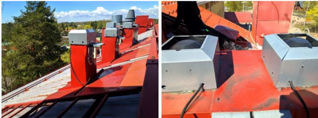
Kuva 26. Yleiskuvat erillispoistopuhaltimista vesikatolla.
