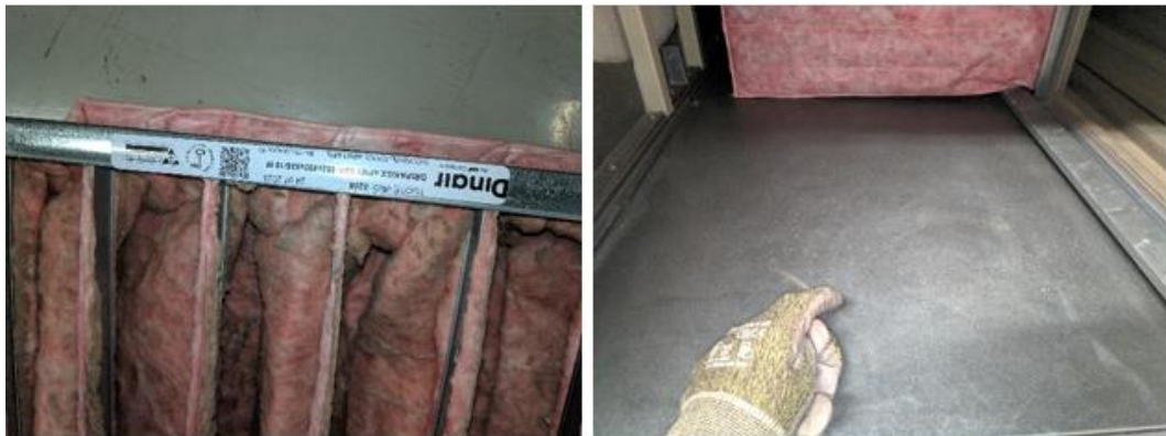
Kuva 13. Ilmanvaihtokoneen tuloilmasuodatin. Tuloilmasuodattimet tiivistyvät konerunkoon ja niissä ei havaittu merkittävää ohivuotoa. Ilmanvaihtokoneen sisäosat ovat siistit. Suodattimet on vaihdettu viimeksi 05.03.2024.
