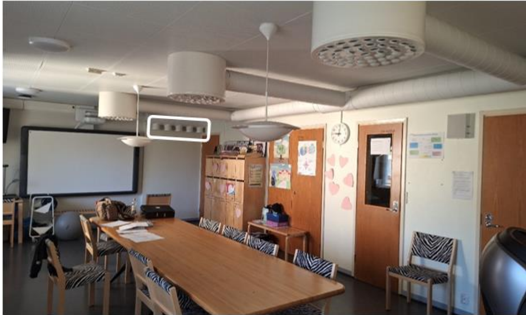
Kuva 34. Yleiskuva opettajainhuoneen ilmanjaon toteutuksesta.
