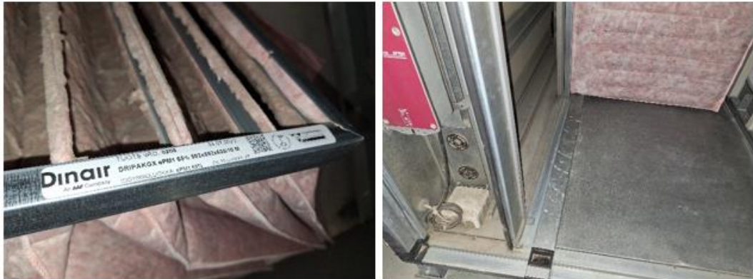
Kuva 19. Ilmanvaihtokoneen tuloilmasuodatin. Tuloilmasuodattimet tiivistyvät konerunkoon ja niissä ei havaittu merkittävää ohivuotoa. Ilmanvaihtokoneen sisäosat ovat siistit. Suodattimet on vaihdettu viimeksi 05.03.2024.
