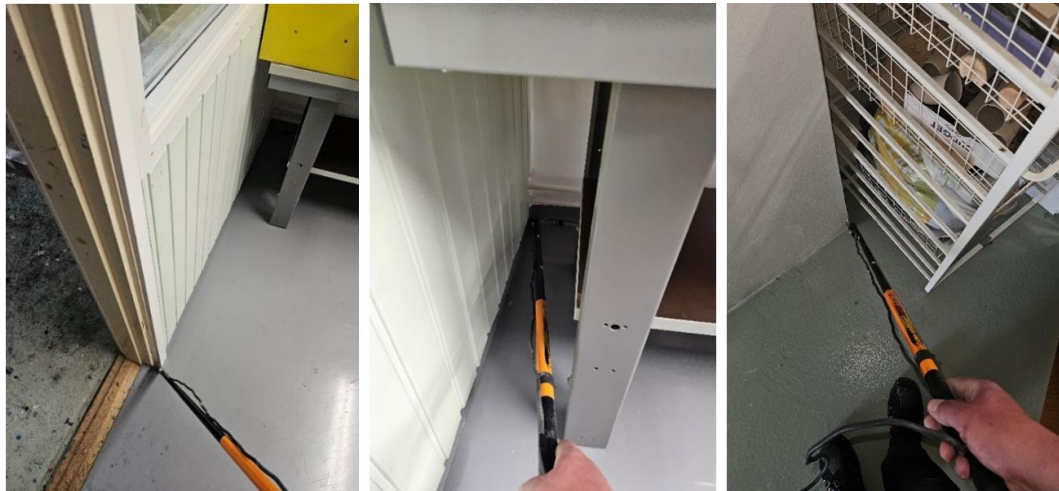
Kuva 64. Maalaamon seinästä puusalin puolelta havaittiin kaksi merkittävää pistemäistä ilmavuotoa. Materiaalivaraston seinän nurkasta havaittiin vähäinen pistemäinen ilmavuoto.
