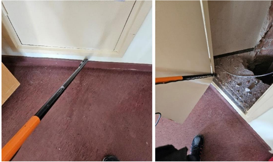
Kuva 65. Kuilun oven karmin liitoksista havaittiin voimakasta pistemäistä ilmavuotoa.
