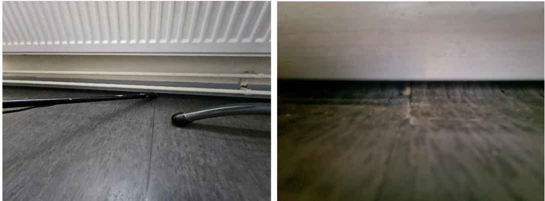
Kuva 73. Muovimaton saumasta havaittiin vähäinen pistemäinen ilmavuoto.
