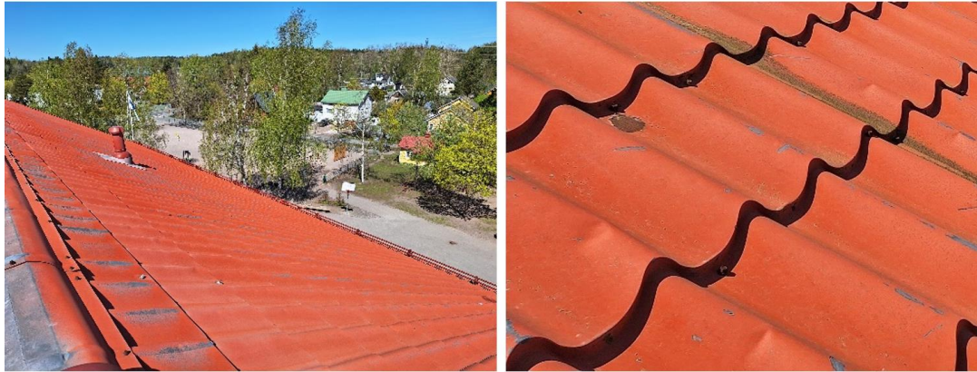
Kuva 50. Kuvia pohjoissivun kattolappesta ja sen verrattain hyvässä kunnossa olevasta muovipinnoitteesta. Pinnoitteessa on melko paljon naarmuja ja muuta kulumaa.
