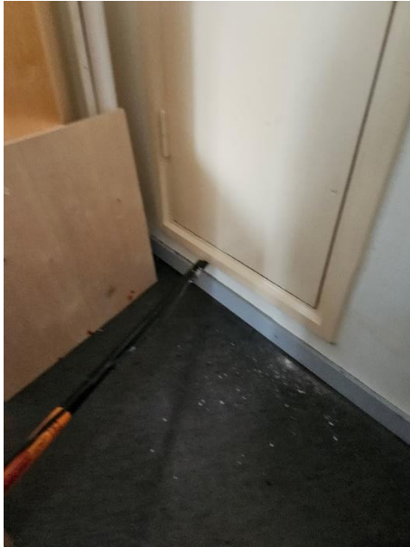
Kuva 69. Kuilun oven listan alta havaittiin merkittävää ilmavuotoa.
