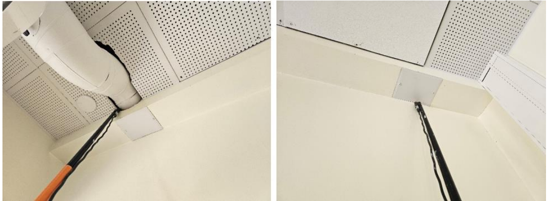
Kuva 89. Alakaton reunasta havaittiin useita ilmavuotoja.
