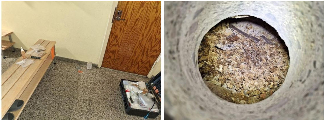
Kuva 45. Luokkaosan ensimmäisen ja toisen kerroksen keskikäytävien molemmista avauksista (RA7 ja RA19) havaittiin voimakas maakellarimainen haju. Ensimmäisen kerroksen avauksesta (RA7) havaittiin selvä ilmavirtaus merkkisavulla, jonka suunta vaihteli ja toisessa kerroksessa (RA19) heikko ilmavirtaus rakenteeseen päin. Molemmissa rakenneavauksissa täyttökerrosten kutterilastu oli tummunutta ja muottilaudoituksessa havaittiin lahoa, vaurioiden ollessa kuitenkin toisessa kerroksessa pahemman näköisiä.
