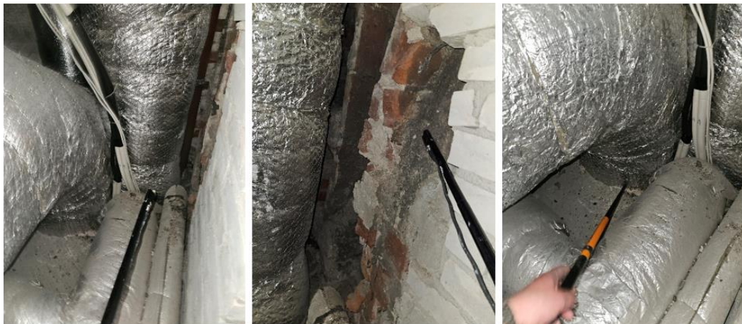
Kuva 94. Kuilun yläpäästä vuoti ullakolle runsaasti ilmaa.
