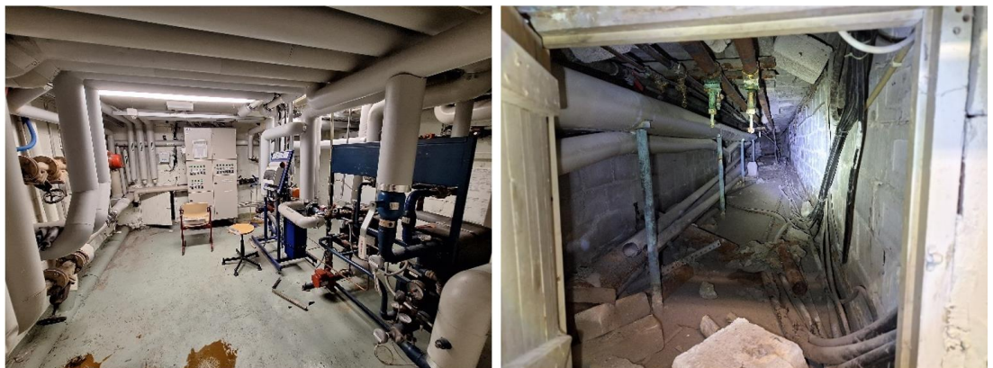
Kuva 15. Asuntolaosassa olevasta lämmönjakohuoneesta on putkitunneli viereiseen museokouluun. Luukku on epätiivis ja tunnelissa on paljon epäpuhtauksia. Yhden opettajan kertoman mukaan tunnelin kautta on tullut voimakasta kreosootin hajua, kun museokoulussa on tehty korjaustöitä, mahdollisesti vuonna 2020 tai 2021.
