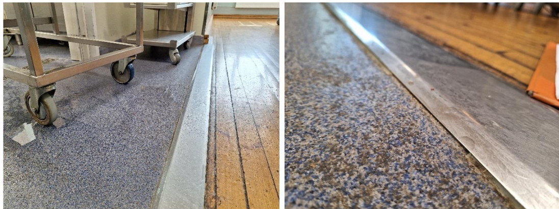
Kuva 17. Ruokalan ja keittiön välissä pintamateriaali vaihtuu akryylimassasta puulattiaan ja liitokseen on asennettu teräslista. Akryylimassalattian puolella käytetään paljon vettä mm. lattioiden pesemiseen. Teräslistan silikonimassaus oli kulunutta ja osittain irronnut kokonaan, jolloin kosteus voi päästä valumaan listan alta puulattian puolelle.
