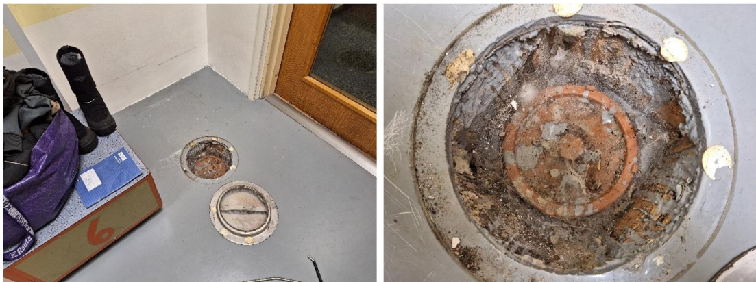
Kuva 20. Kellarissa on metallisia pyöreitä lattialuukkuja, joiden sisällä on viemäriputken tarkastus-/puhdistusyhde. Luukut on valettu ympäriltä ja niiden sisäpuoleinen muottilaudoitus on purkamatta. Luukut ovat sisältä hyvin likaisia ja niiden kannet ovat epätiivit.
