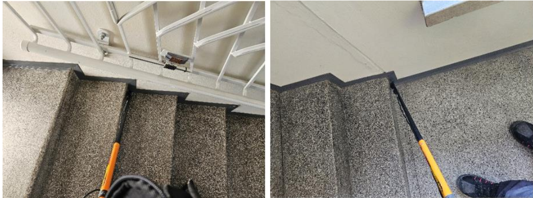
Kuva 91. Portaiden ja seinän liitoskohdista havaittiin vähäisiä pistemäisiä ilmavuotoja.
