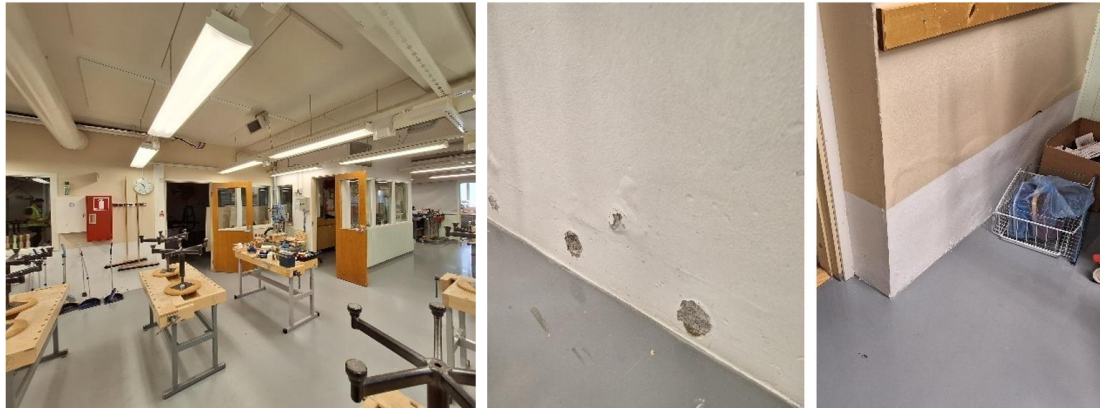
Kuva 12. Puutyöluokan 033 konesalin ja käytävän vastaisen väliseinän alaosa kupruilee käytävää 018 vastaavasti. Yhdessä kohdassa tasoite kupruilee ylempää seinässä. Myös näihin väliseiniin on tehty injektiokorjauksia.
