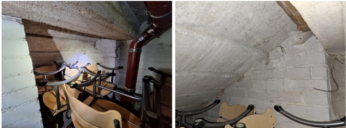
Kuva 14. Asuntolaosuuden portaiden alustila on tehty varastoksi. Tilassa havaittiin maakellarimaista hajua ja porraskenteiden betonissa puuainesta. Tilassa varastoitiin koulun penkkejä eikä alustilaa pystytty tarkastamaan kokonaisvaltaisesti runsaan tavaramäärän takia.
