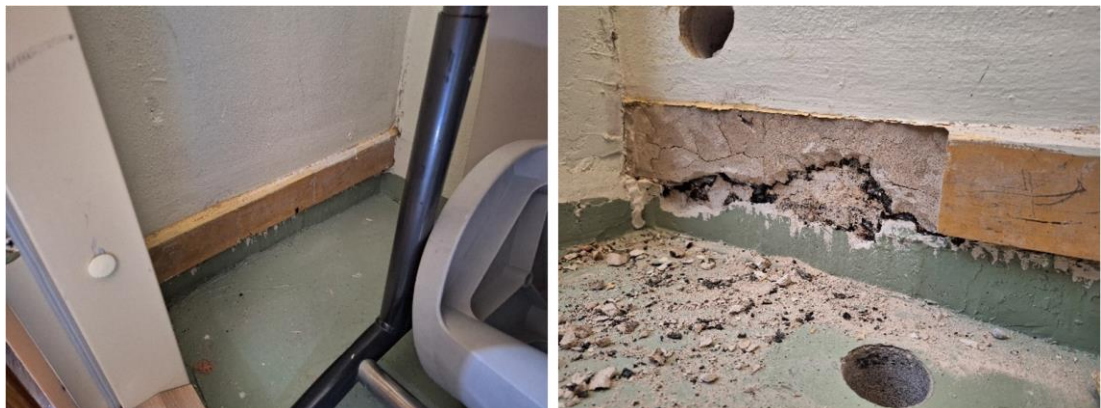
Kuva 31. Luokan 221 komerossa havaittiin alkuperäinen laattajalkalista. Tilan kohdalla on ollut alun perin WC-tila, jonka lattian pintarakenteet on purettu. Laatoituksen takana on alkuperäistä pikisivelyä.
