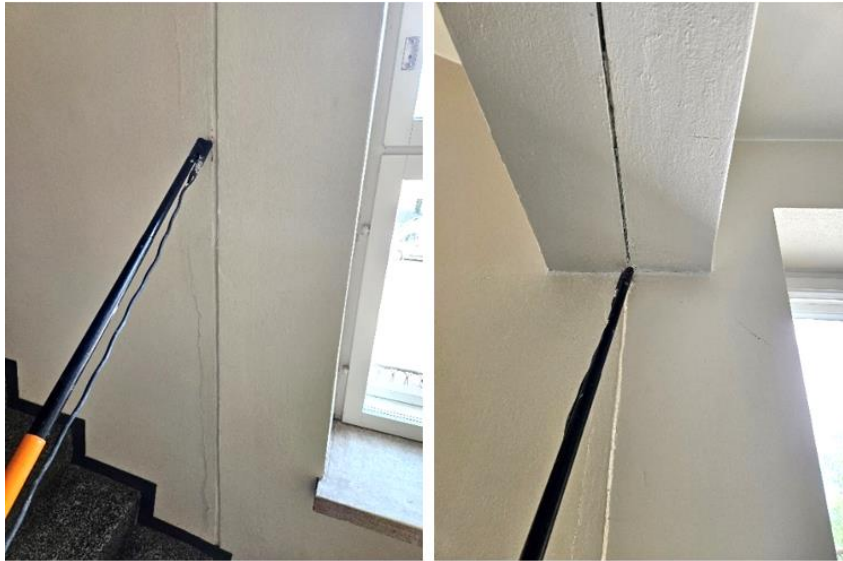
Kuva 93. Liikuntasaumasta havaittiin vähäistä ja merkittävää ilmavuotoa.
