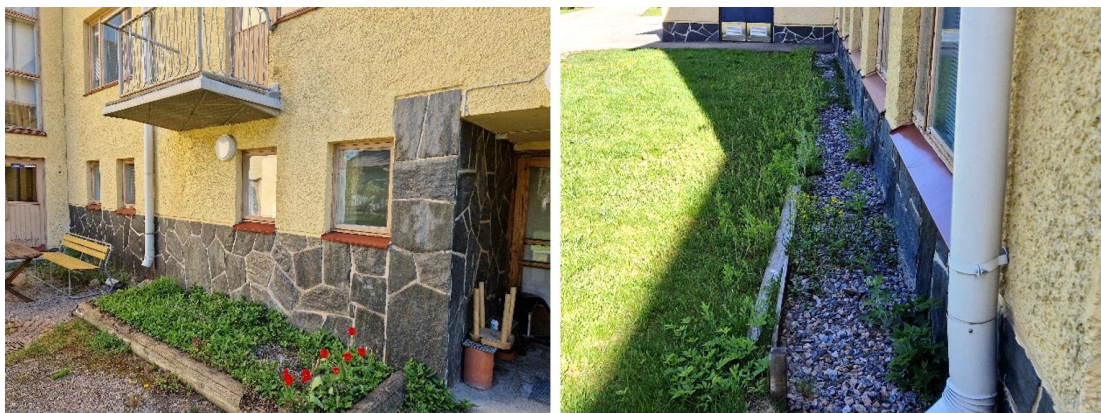
Kuva 4. Rakennuksen asuntolaosuuden viereisellä hiekoituksella kasvaa kasvillisuutta. Asuntolaosuudella parvekkeiden alapuolelle rakennuksen viereen on tehty istutusaltaita, joissa maa-aines vaikuttaa olevan suorassa kosketuksessa julkisivupintaan (vasen). Luokkaosan lounaispuolella rakennuksen viereisissä sorastusalueissa on kasvillisuutta (oikea).
