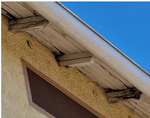
Kuva 55. Luukkasiiven pohjoissivulla räystäänauluslaudoissa sekä kattokannattimien päissä oli havaittavissa selkeitä kosteusjälkiä ja viitteitä lahovaurioista. Kuvien kohdalla sijaitsee ullakolle rakennettu IV-konehuone ja kuvassa näkyy raitisilmasäleikkö.
