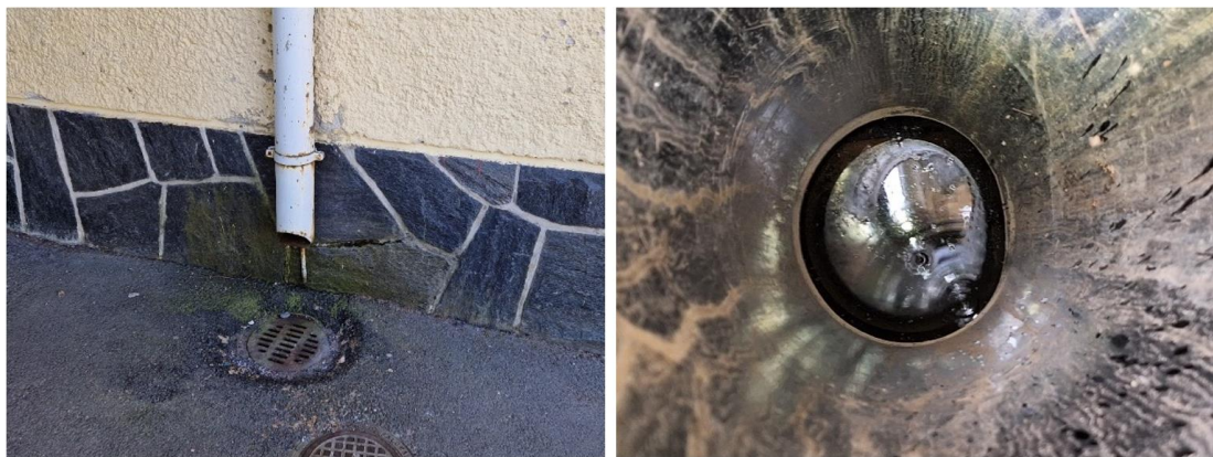
Kuva 6. Syöksytorven alaosa on kastellut julkisivua yhdessä kohdassa juhlasaliosuudella koillispuolella rakennusta. Osa rakennuksen syöksytorvien päistä on liian ylhäällä maanpinnan tasosta, jolloin sadevedet johtuvat maanpinnalle osittain hallitsemattomasti. Yhdessä salaojan tarkastuskaivossa havaittiin seisovaa vettä ja salaojaputkien päät olivat mahdollisesti osittain vedenpinnan alapuolella. Salaojien tarkastuskaivoja tarkasteltiin pistokoeluonteisesti.
