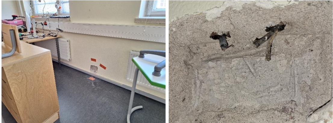
Kuva 32. Luokan 221 ulkoseinässä havaittiin vanhoja sähköjohtoja, joiden suojaputki on metallia ja suojaputki on täytetty kreosootilla (Bergmanin putki). Kohdassa on ollut todennäköisesti aiemmin vanha pistorasia.
