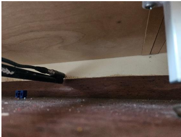
Kuva 66. Maton ylösnoston yläreunasta havaittiin merkittävää ilmavuotoa. Liima on kammattu pystysuunnassa, jolloin ilmavuotoa tapahtuu liimaharjanteiden välistä.
