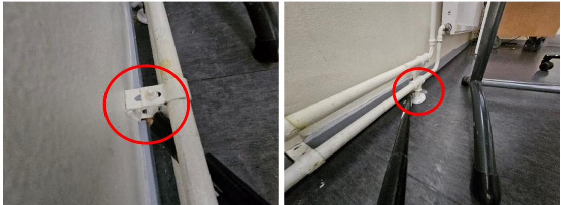
Kuva 75. Patteriputken kannakkeesta ja patteriputken läpiviennistä havaittiin pistemäiset vähäiset ilmavuodot.
