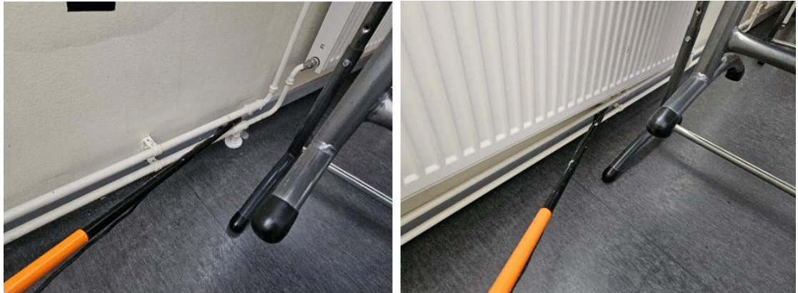
Kuva 81 a ja b. Patteriputkien kannakkeista havaittiin yleisesti eri asteisia pistemäisiä ilmavuotoja.
