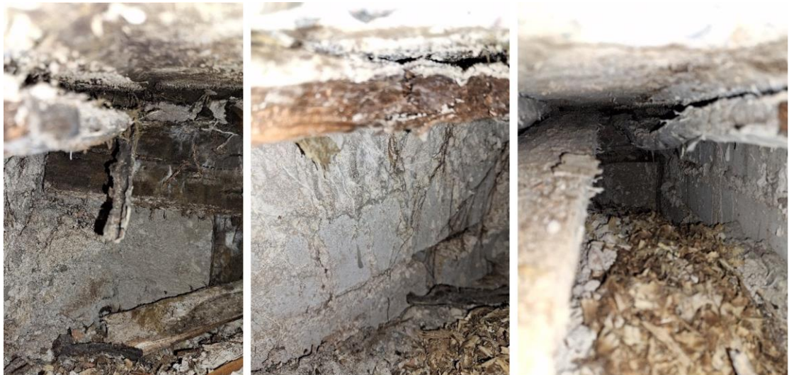
Kuva 46. Kuvia toisen kerroksen rakenneavauksesta RA19 välipohjan palkkivälistä. Välipohjan muottilaudoitusta ja kutterilastu on selvästi kosteusvaurioitunut ja välipohjan seinämällä on nähtävissä selvää kasvustoa (todennäköisesti lahottajien rihmasto). Rakenneavaus tehtiin käytävälle käytävän ja pienryhmätilan 220 välisen seinän viereen.
