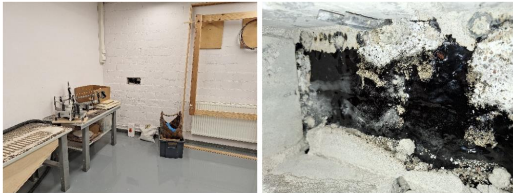
Kuva 24. Konesalin 032 kuorimuuratun maanvastaisen seinän avaus (RA6). Kuorimuurauksen takana betonipinnassa on kulunut pikisively. Kuorimuuraus oli kohdassa kalkkiahiekkatiiltä. Avauksesta havaittiin selvää maakellarimaista hajua.
