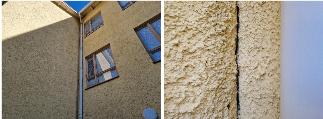
Kuva 5. Rakennuksen julkisivun nurkassa ei ole erillistä saumamassausta.
