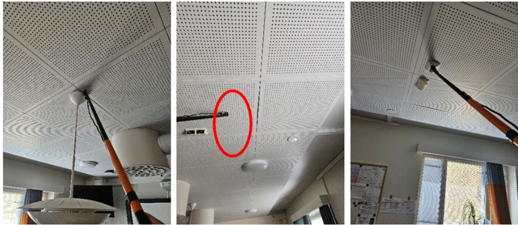
Kuva 83. Alakaton läpivienneistä ja levyjen läpi havaittiin merkittävää ilmavuotoa. Merkkiainetta kertyy levytyksen taakse laajalle alueelle.
