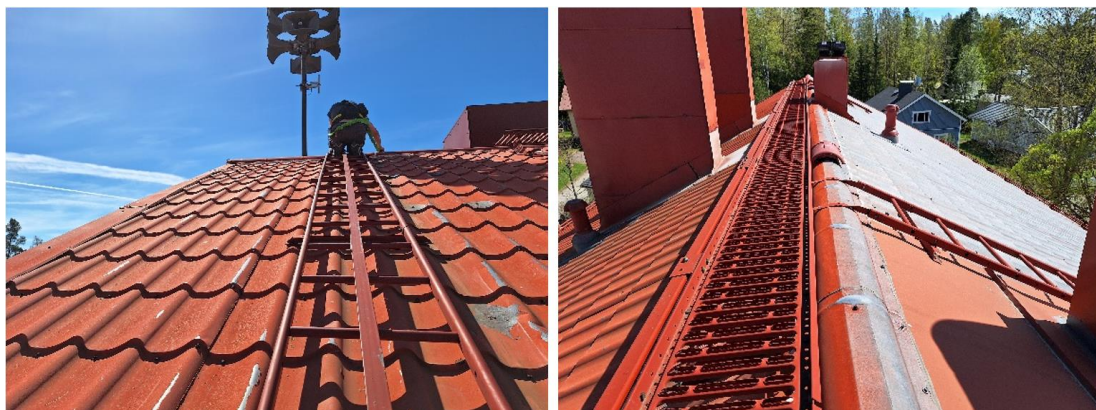
Kuva 52. Lapetikkaissa on valjaille kiskot, kulkusilloissa ei.
