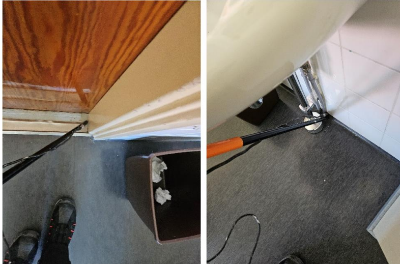
Kuva 71. Voimakas pistemäinen ilmavuoto oven karmin ja kynnyksen liitoksesta (kuva a) sekä voimakas ilmavuoto putkien läpiviennin kohdalta (kuva b).
