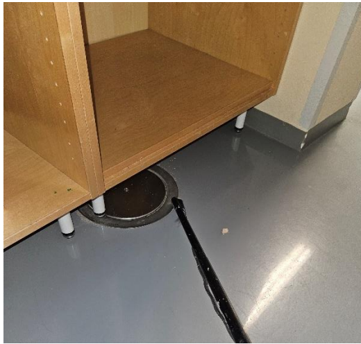
Kuva 62. Valmiiden töiden varaston viereisessä eteisessä olevan kaivon reunasta havaittiin merkittävää pistemäistä ilmavuotoa.
