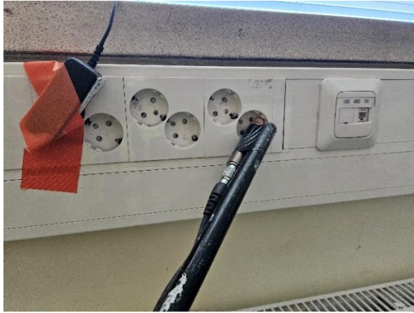
Kuva 78. Pistorasiasta ikkunapenkin alta, havaittiin vähäinen pistemäinen ilmavuoto.
