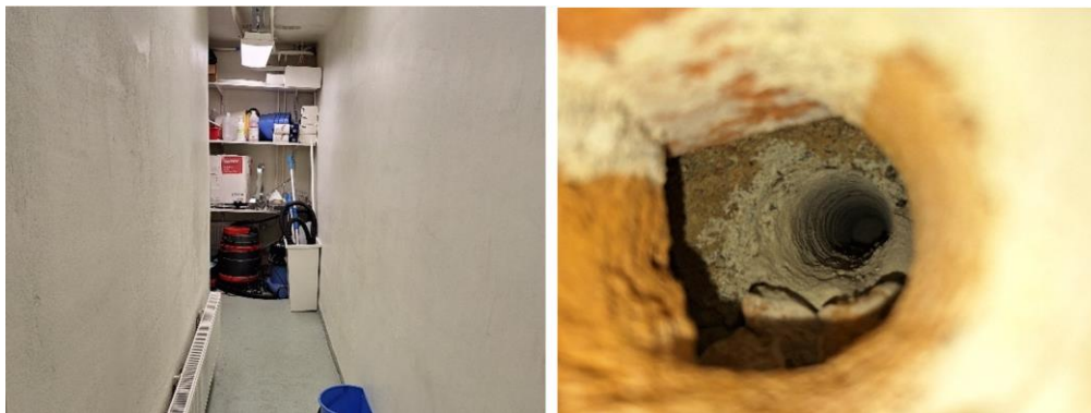
Kuva 25. Varaston 012 kuorimuuratun maanvastaisen seinän avaus (RA25). Avauksessa ei havaittu pikisivelyä betonin pinnassa. Kuorimuuraus oli kohdassa punatiiltä.
