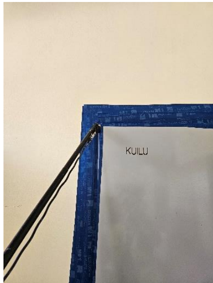
Kuva 87. Kuilun oven teippaus oli leikattu auki ja ovi vuoti voimakkaasti.
