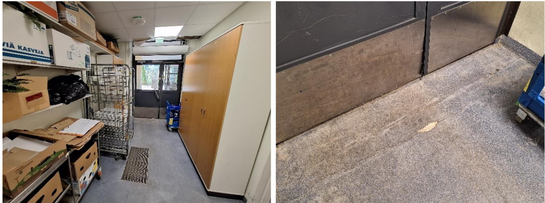
Kuva 16. Keittiön sisäänkäynnin edessä akryylimassalattiassa on isohko halkeama.
