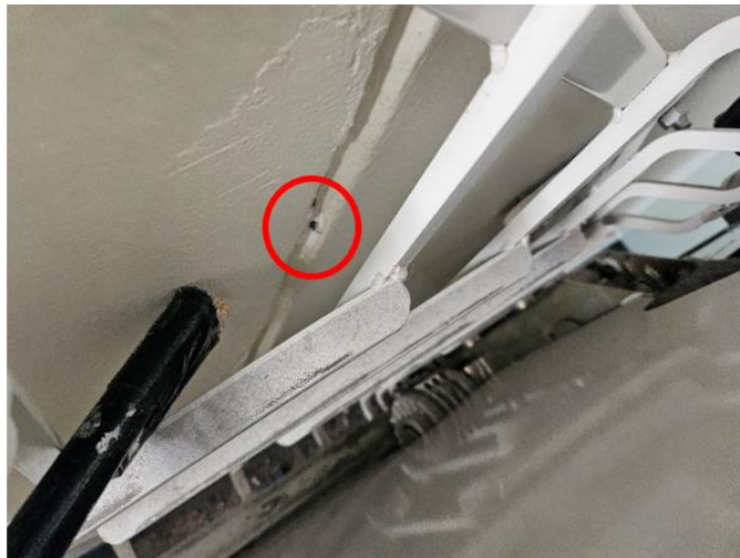
Kuva 92. Seinän saumassa olevasta reiästä havaittiin merkittävä pistemäinen ilmavuoto.
