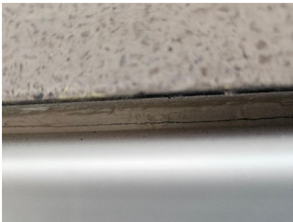
Kuva 77. Ikkunapenkin alla on tyypillinen kutistumarako.
