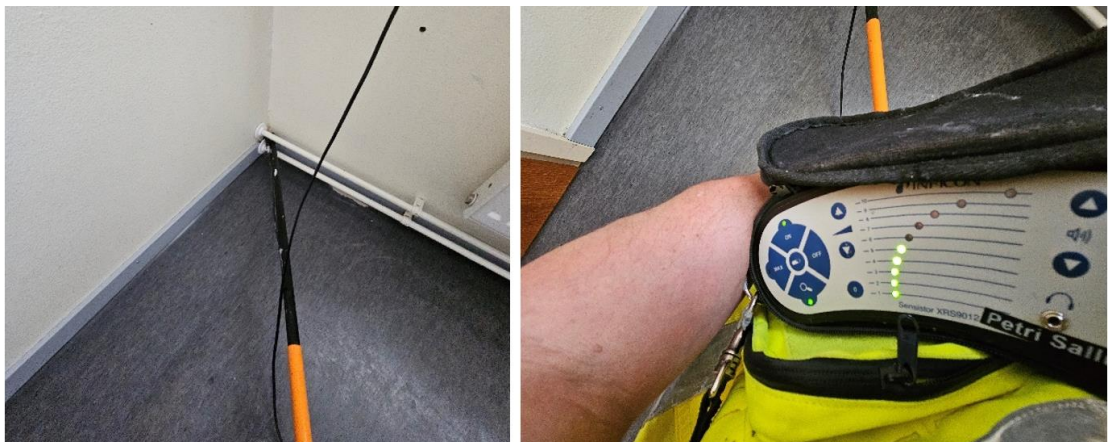
Kuva 74. Vasemman nurkan patteriputkien kohdalta havaittiin merkittävää pistemäistä ilmavuotoa.
