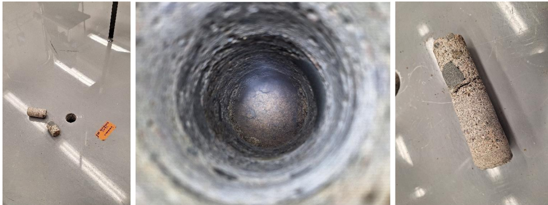
Kuva 19. Konesalin 032 alapohjan rakenneavaus (RA1) alkuperäisen rakenteen alueella. Laatassa ei havaittu alkuperäisten suunnitelmien mukaista bitumisivelyä ja maa-aineksena laatan alla oli hiekkaa. Uusituilla alueilla alapohjassa on solupolystyreeni (XPS) laatan alapuolella.
