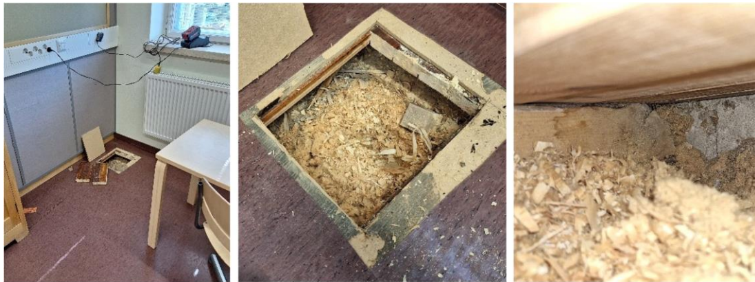
Kuva 43. Rakenneavaus RA26 luokassa 112. Puukannellisissa välipohjissa on alkuperäinen ponttilaudoitus muovimaton ja puukuitulevytyksen alapuolella. Ponttilaudoituksessa havaittiin useammassa avauksessa vähäisiä siivousvesien kosteusjälkiä laudoituksen yläpinnassa. Avauksessa RA26 havaittiin pieni kosteusjälki koolauspuun päässä väliseinän vieressä. Kosteusjäljet olivat havaintojen perusteella vanhoja ja kuivia.
