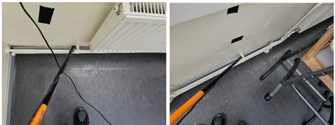
Kuva 80 a ja b. Patteriputkien kannakkeista havaittiin yleisesti eri asteisia pistemäisiä ilmavuotoja.
