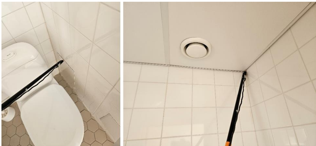
Kuva 90. WC:ssä 225 havaittiin kaksi voimakasta ilmavuotoa.
