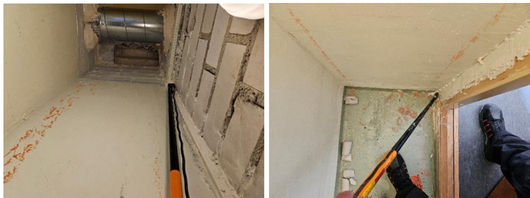
Kuva 88. Viereisen komeron tiivistykset eivät olleet täysin tiiviitä.
