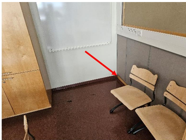
Kuva 68. Luokan toisessa päässä havaittiin vähäinen pistemäinen ilmavuoto nurkasta.
