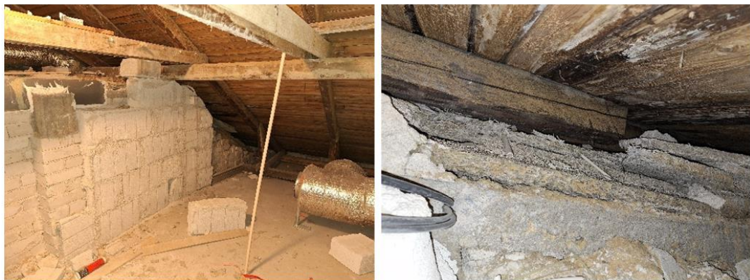
Kuva 57. Juhlasalin päädyssä olevien pukuhuone- ja suihkutilojen lastuvillaeristeet ovat käytännössä kiinni vesikaton aluslaudoituksessa heikentäen rakenteen tuulettuvuutta ja kuivumiskykyä (Leikkaus: Juhlasalin tyttöjen pukuhuoneen katto 1:50, Pekka Lappalainen, 18.8.1950).
