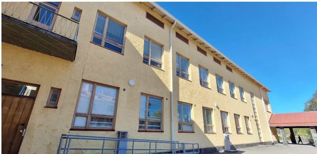
Kuva 29. Yleiskuva ulkoseinästä luokan 221 kohdalta rakennuksen koillispuolelta. Seinässä näkyy ensimmäisen kerroksen tasolla ikkunoiden vieressä vanhat korvausilmasäleiköt, jotka ovat ummistettuja sisäpuolelta. Katonrajassa näkyy nykyiset tuloilmakammion raitisilmasäleiköt ja niiden alapuolella kaksi pientä reikää, jotka ovat olleet ullakkotilan alkuperäiset ilmanvaihto- ja sammutusvedenpoistoreiät. Ilmanvaihtokonehuoneen kohdalla näkyy raitisilmasäleikön yläpuolella ylimääräiset ilma-aukot, joiden tarkka käyttötarkoitus ei ole tiedossa. Todennäköisesti aukot on lisätty ilmanvaihtokonehuoneen rakentamisen yhteydessä, koska niitä ei
