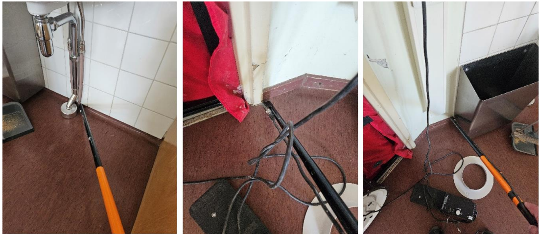
Kuva 67. Käytävän vastaisella seinällä havaittiin pistemäistä vähäistä ilmavuotoa lavuaarin putkien läpiviennistä, oven karmin juuresta ja laatoituksen reunasta.
