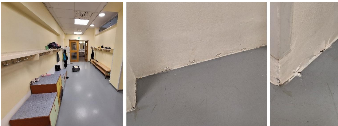
Kuva 11. Käytävän 018 keittiön vastaisen seinän alaosien tasoite kupruilee. Käytävän lattiamateriaalina on massapinnoite. Seinän juureen on tehty injektointikorjauksia, joilla on pyritty estämään kosteuden nousu seinärakenteeseen. Kupruilu on pääasiassa paikallista ja paikoin sijoittuu injektointityön porauskohtiin.
