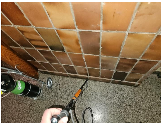
Kuva 84. Kuilun kohdalta, käytävän puolelta, havaittiin vähäistä viivamaista ilmavuotoa lattian ja seinän nurkasta.
