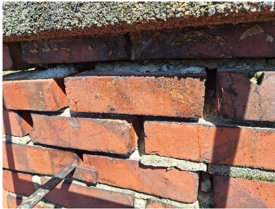
Kuva 54. Savupiipun tiilisaumat olivat heikossa kunnossa ja paikoin tiiliä oli lähes irrallaan.
