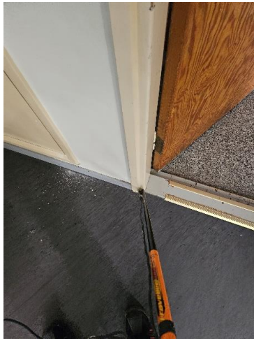
Kuva 85. Toisen kerroksen luokan 213 oven karmin juuresta havaittiin vähäistä pistemäistä ilmavuotoa.
