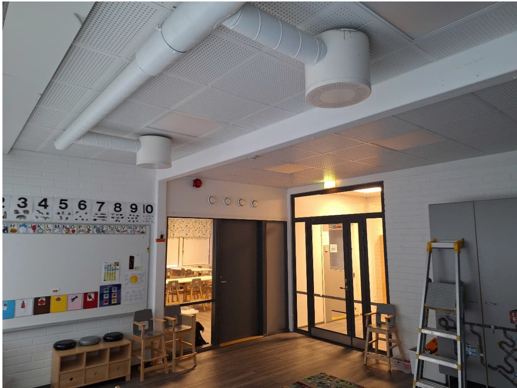
Kuva 78. Yleiskuva ryhmähuoneen 117 ilmanvaihdosta. Tuloilmalaitteet ovat kattoon asennettuja tuloilmahajottajia ja poistoilmalaitteet seinään asennettuja kartioventtiileitä.
