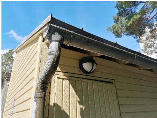
Kuva 9. Kourut ja syöksytorvet olivat havaintojen mukaan erittäin likaiset ja kourut täynnä havunneulasia ja maalipintojen osalta paikoin vaurioituneet, mutta pääosin toimivat.
