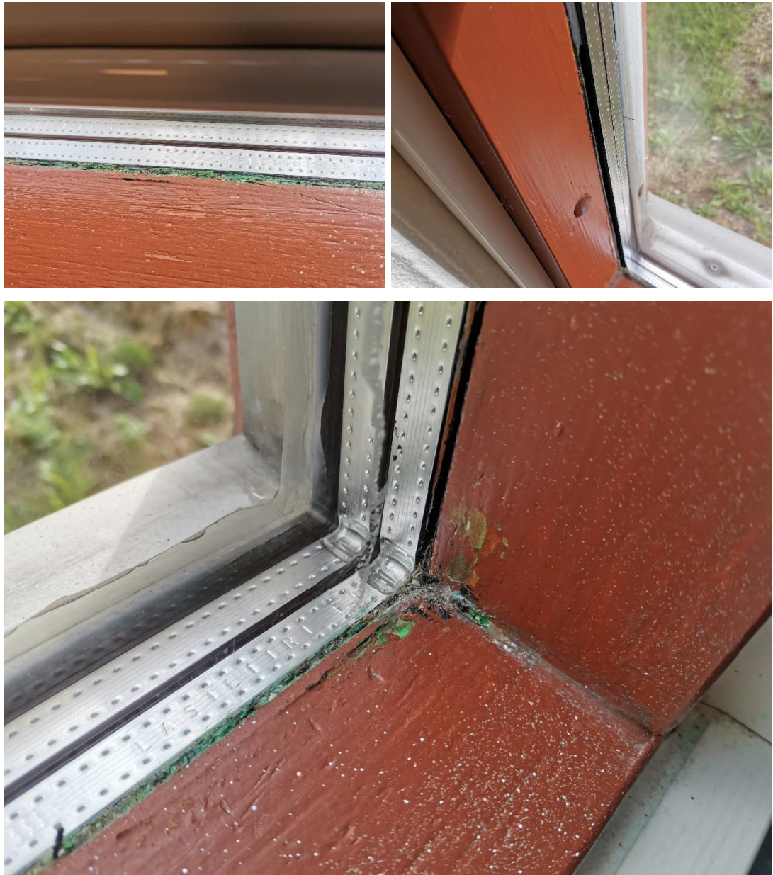
Kuva 37 a-b. Vanhojen puuelementti-ikkunoiden elementtisaumoissa havaittiin vaurioita ja saumojen murenemista.
