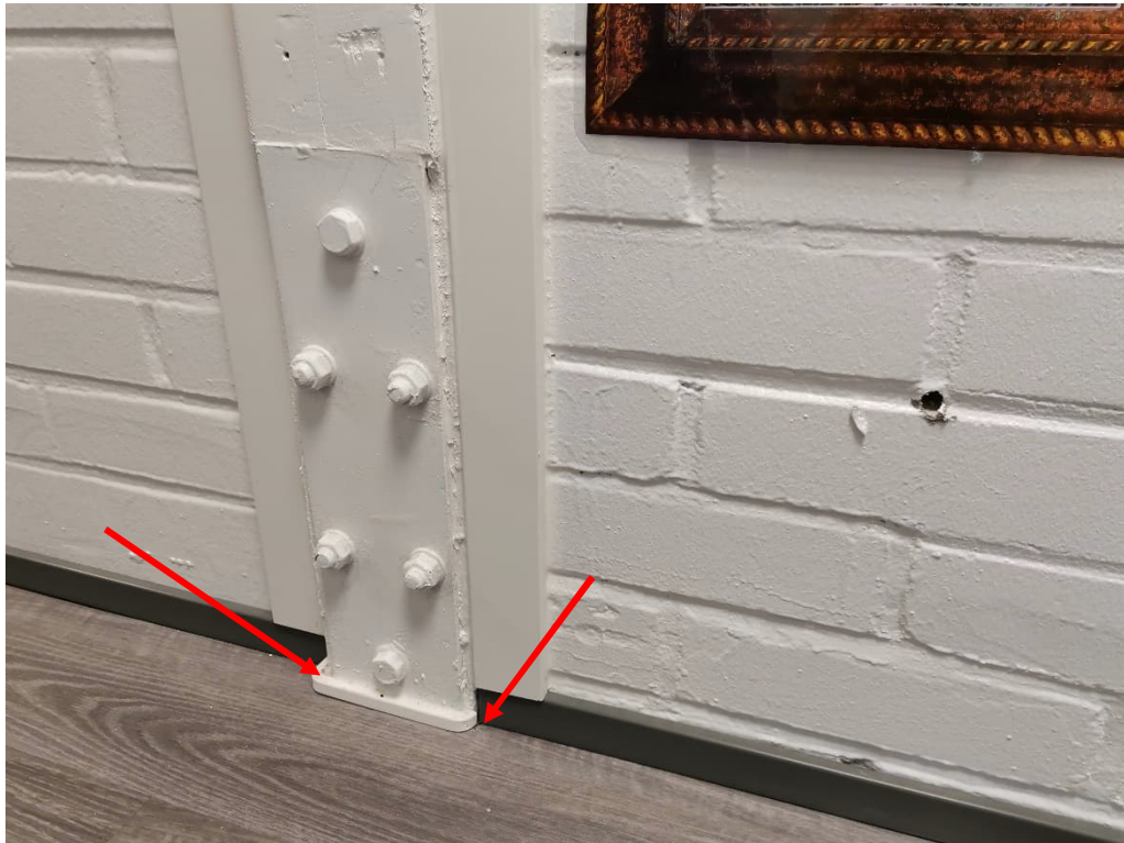
Kuva 51. Käytävän 138 ja ryhmätilan 139 väliseinään tehdyssä merkkiainekokeessa havaitut paikalliset vuotokohdat esitetty punaisiin nuolin ja lähikuvat vuotokohdista.
