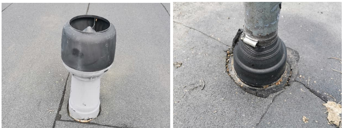
Kuva 62 a-b. Alipainetuulettimet jäävät havaintojen mukaan lyhyiksi (< 300 mm) ja liittymät bitumikermiin vaikuttavat epätiiviiltä.
