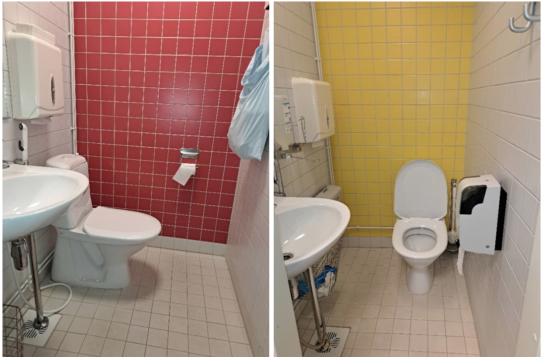
Kuva 48 a-b. Märkätilojen seinät ovat yleisesti siistit, eikä kohonneita pintakosteusarvoja havaittu.
