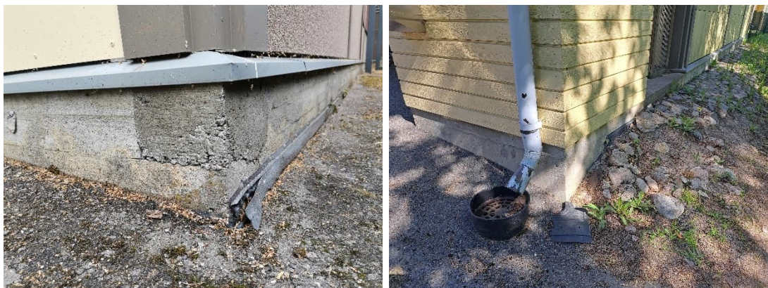
Kuva 5. Paikoin sokkelia vasten asennettu perusmuurilevy on näkyvissä ja tämän suojareunus vaurioitunut.
