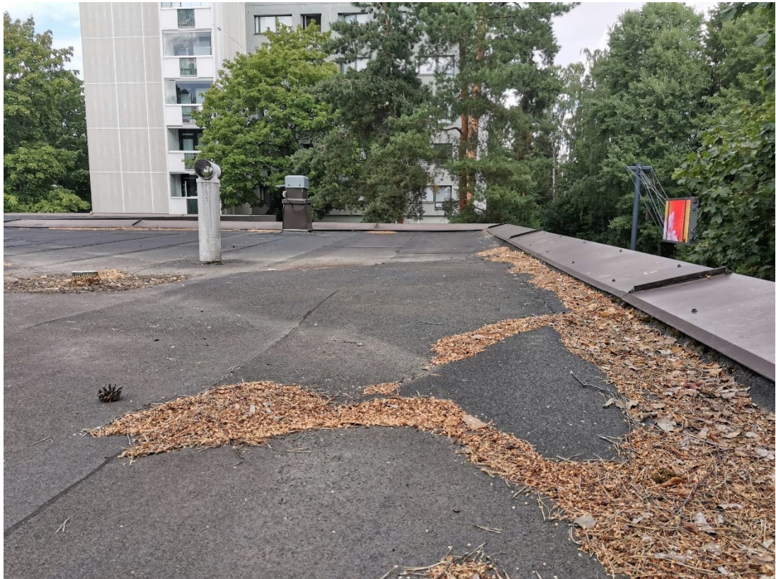
Kuva 61. Bitumikermässä havaittiin painaumia ja yksittäisiä "ilmavia" kohtia, jotka on irronneet alustastaan.
