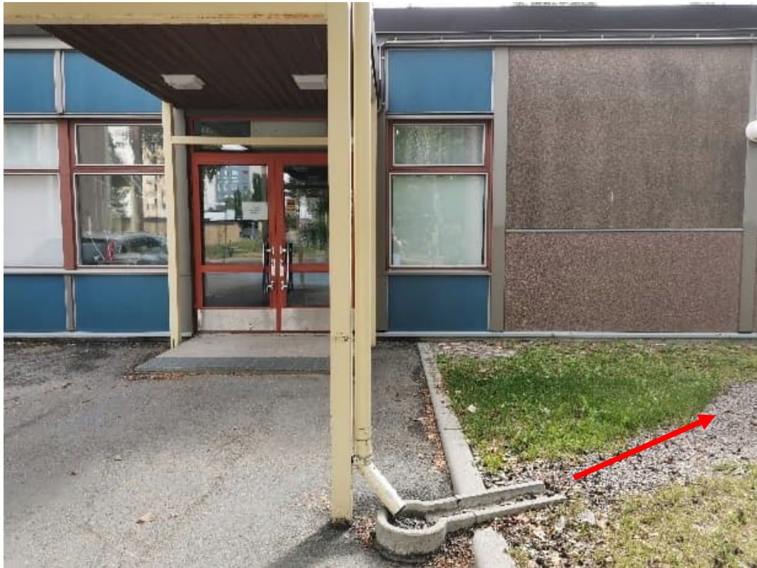
Kuva 10. Pääsisäänkäynnin katokselta johdetut vedet päätyvät rankkasateella rakennuksen vierustalle betonisen loiskekourun huonon suuntauksen ja maaperän kallistusten myötä.
