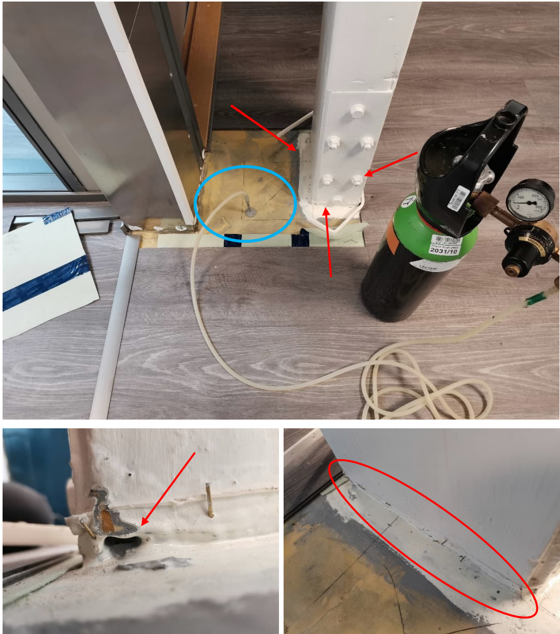
Kuva 23. Käytävän 138 alapohjaan tehdyssä merkkiainekokeessa havaitut paikalliset vuotokohdat esitetty punaisiin nuolin. Kaasun syöttöpaikka merkattu sinisellä.
