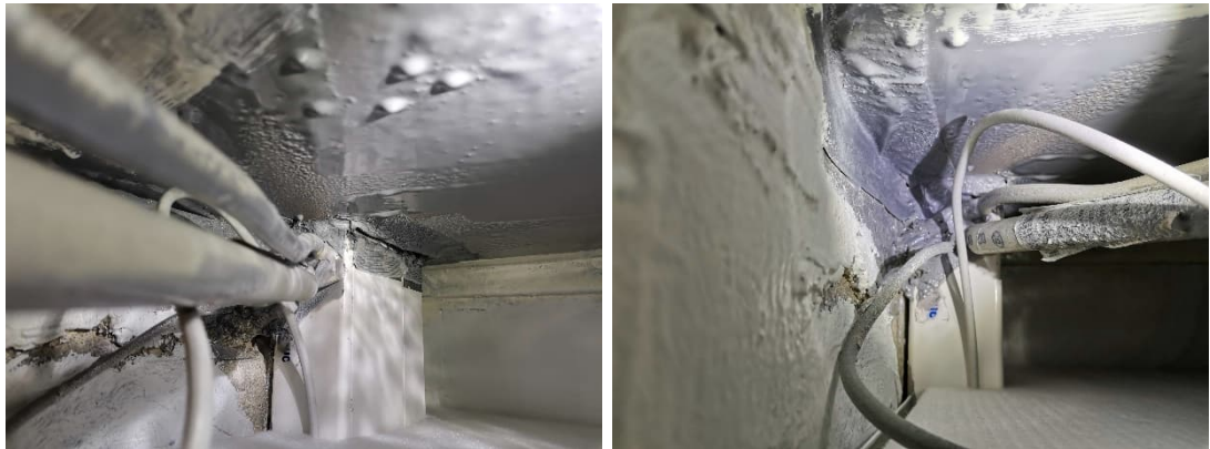
Kuva 55 a-b. Tilan 15 yläpohjan sähköläpiviennit olivat aistinvaraisesti tarkasteltuna epätiiviiit.
