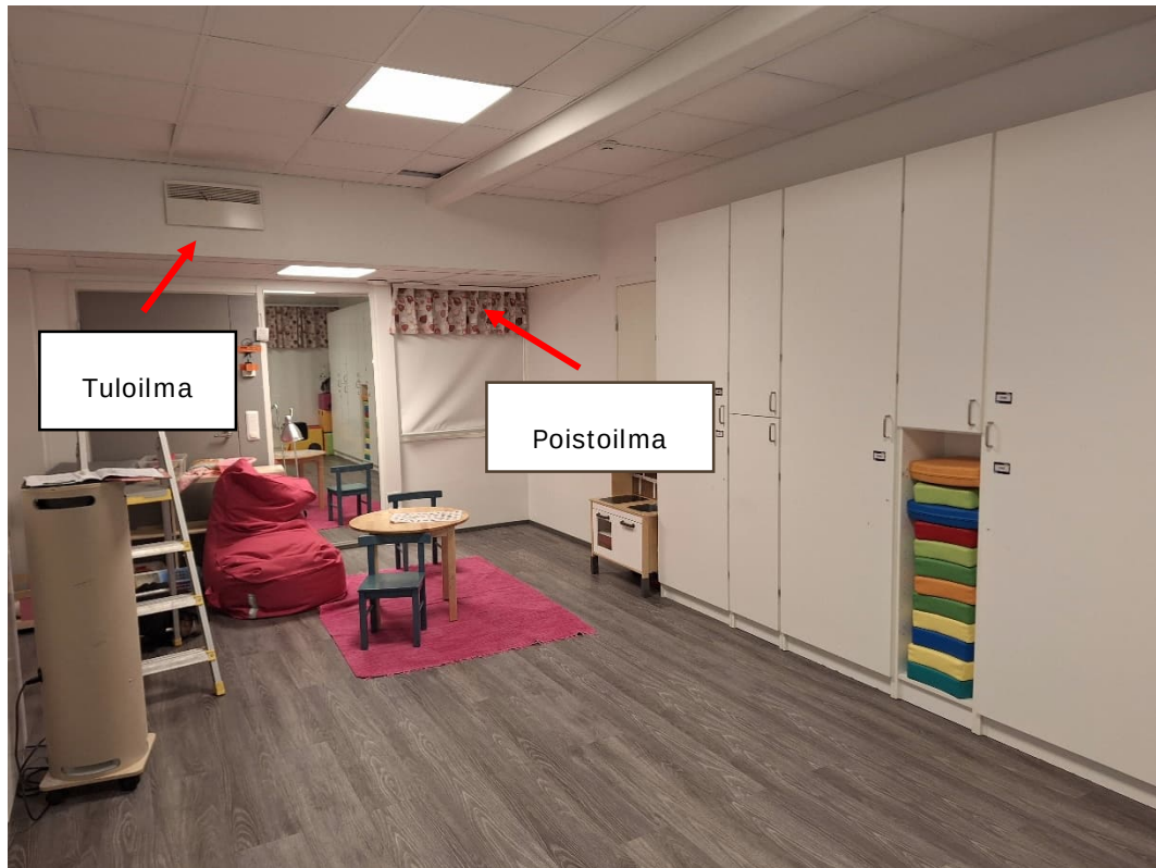
Kuva 77. Yleiskuva lepohuoneen ilmanvaihdosta. Tuloilman säleiköt on sijoitettu käytävänpuoleiselle seinälle ja poistoilmaventtiilit ovat sijoitettu lähelle kattopintaa. Kuvassa on tila 123.
