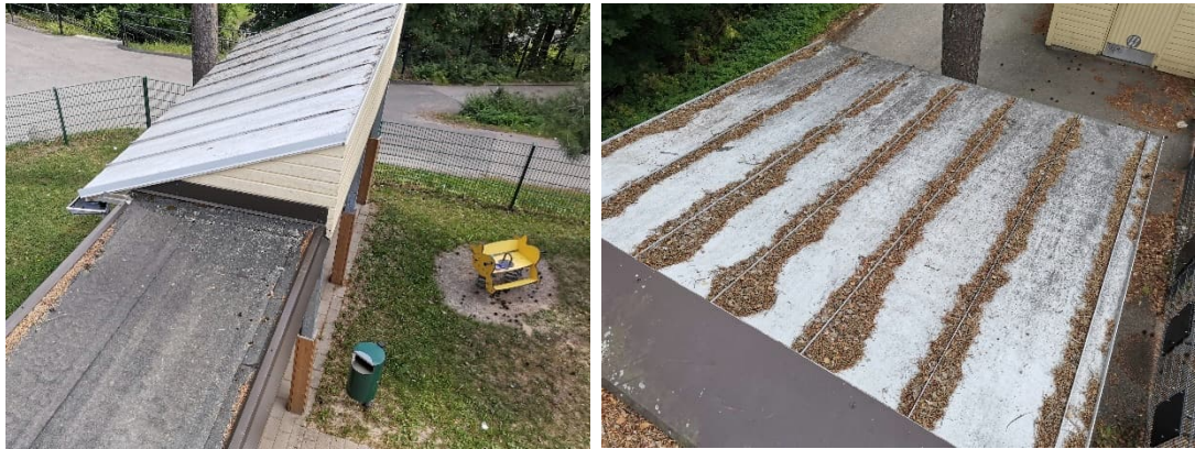
Kuva 63 a-b. Peltisten katosrakenteiden kattopinnat ovat pääosin tyydyttävässä kunnossa ja maalipinnat kuluneita.
