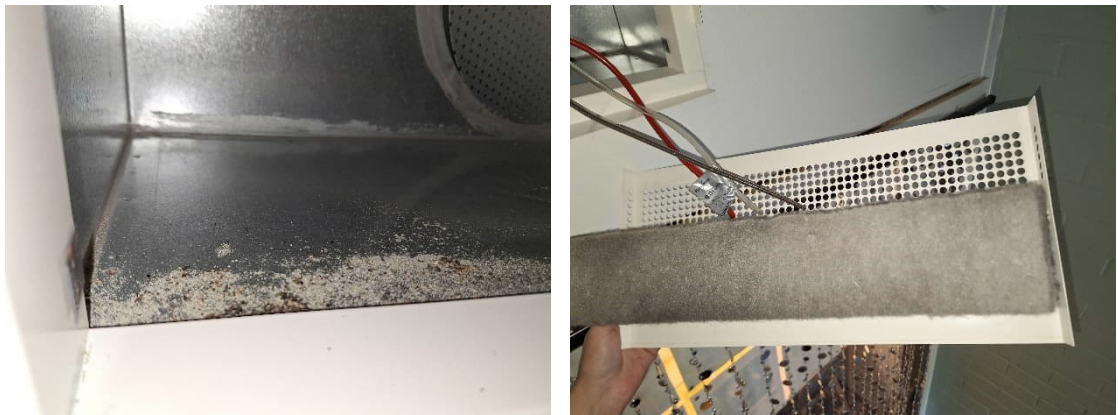
Kuva 79. Yleiskuvat tuloilmalaitteen sisäosista. Tuloilmapäätelaitteissa havaittiin karkeaa kiviainesta. Äänenvaimennusmateriaalissa ei havaittu kuitulähteitä.
