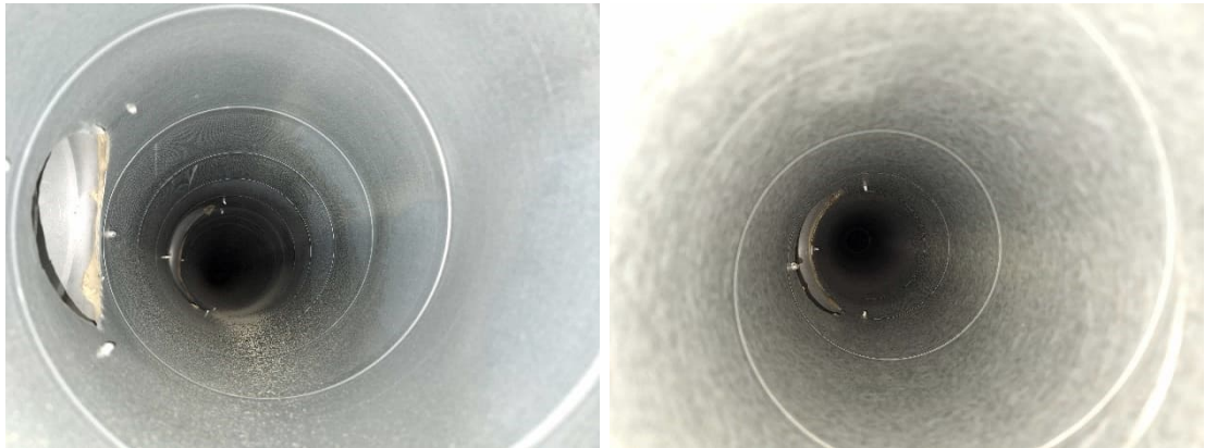
Kuva 76. Yleiskuvat tulo- ja poistoilmakanavista. Poistoilmakanavassa havaittiin pölynkertymää.
