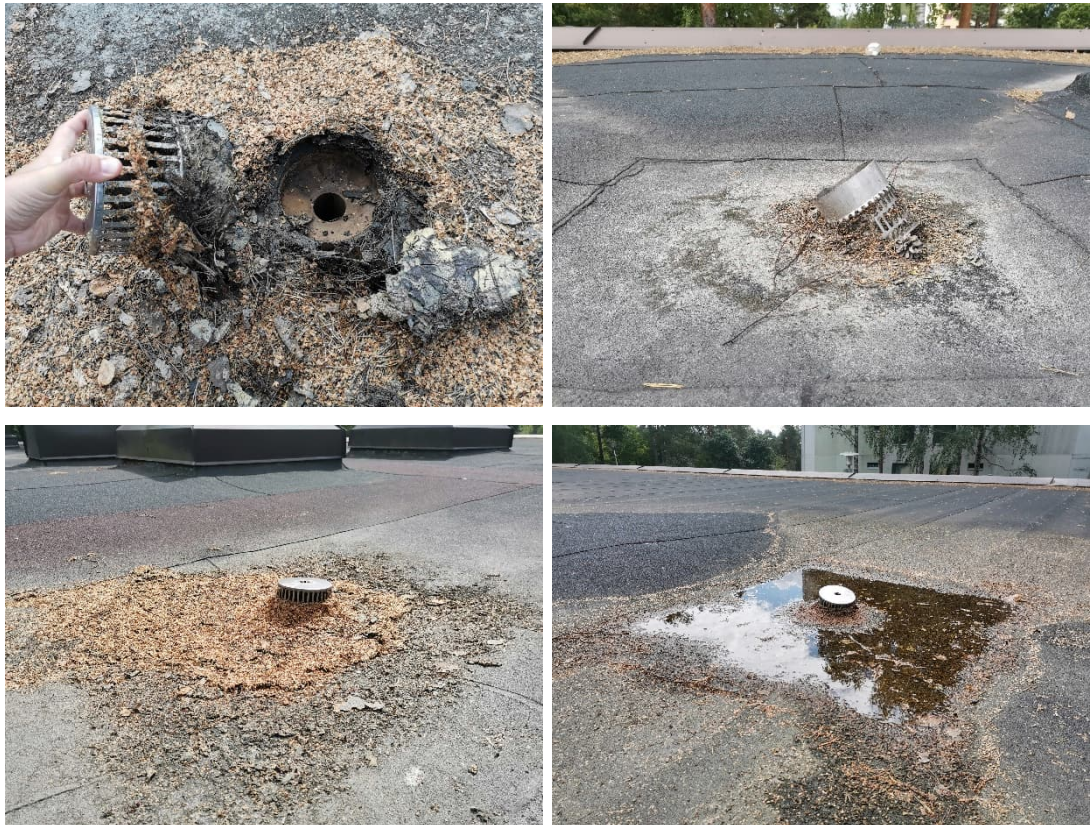
Kuva 60 a-d. Yleisesti kaikkien kaivojen lehtisihdit olivat tukkeutuneet orgaanisesta jätteestä. Lisäksi sihdit olivat osin huonosti paikallaan tai puuttuivat kokonaan.
