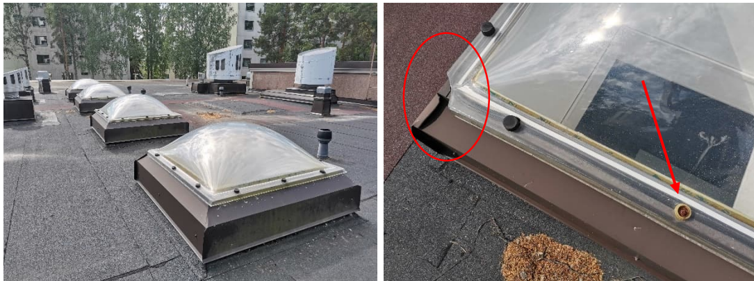
Kuva 64 a-b. Vesikatolla olevat kattokupuikkunat ovat pääosin ehjiä, eikä aktiivisia vesivuotojälkiä havaittu. Ikkunoiden kiinnikesuojia oli irronnut ja yksittäisen ikkunan kuvunkulmaus vaurioitunut.
