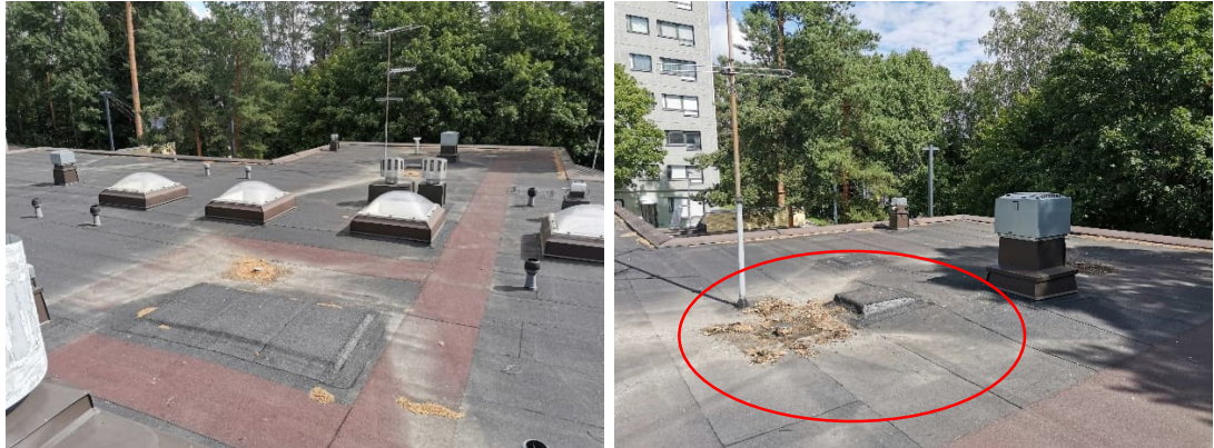
Kuva 59 a-b. Yleiskuvia kaakonpuoleiselta vesikaton osalta. Katolla myös näiltä osin on useita alueita, joihin vesi pääsee lammikoitumaan. Kuvassa punaisella rajattu alue, joka osuu aiemmin tilassa 49 sattuneen vuotokohdan yläpuolelle.
