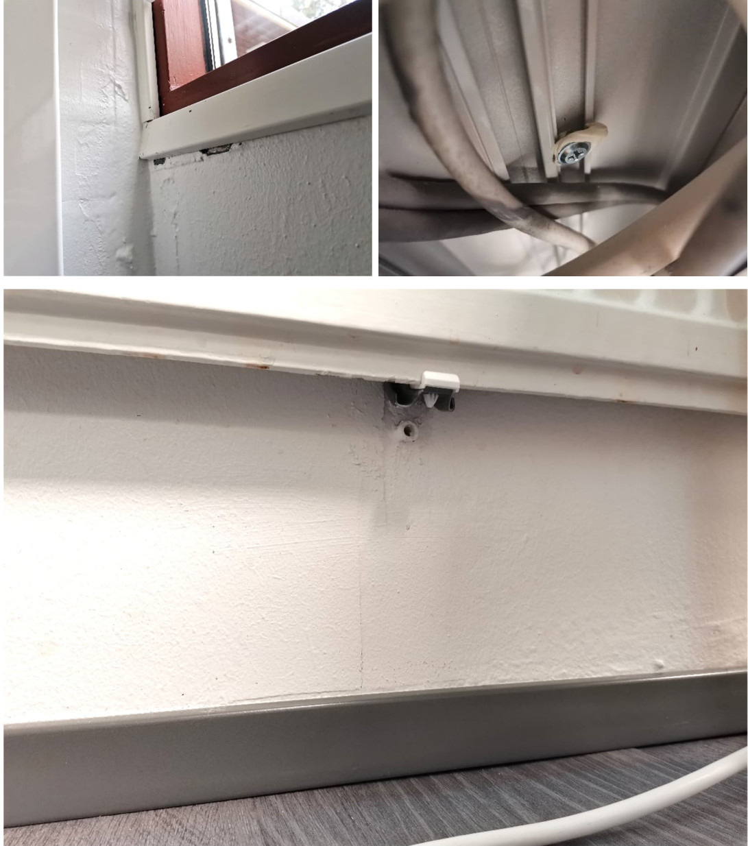
Kuva 35 a-b. Paikallisia puutteita havaittiin lisäksi kaikkien ulkoseinien tiivistyksien osalta, jossa levyseinän ruuvien kiinnityksissä käytetyt tiivistysmassat ovat heikosti asennetut tai puuttuivat kokonaan. Sekä mahdollisesti ikkunalistojen irrotuksesta aiheutuvia tiivistysmassojen repeämisiä.
