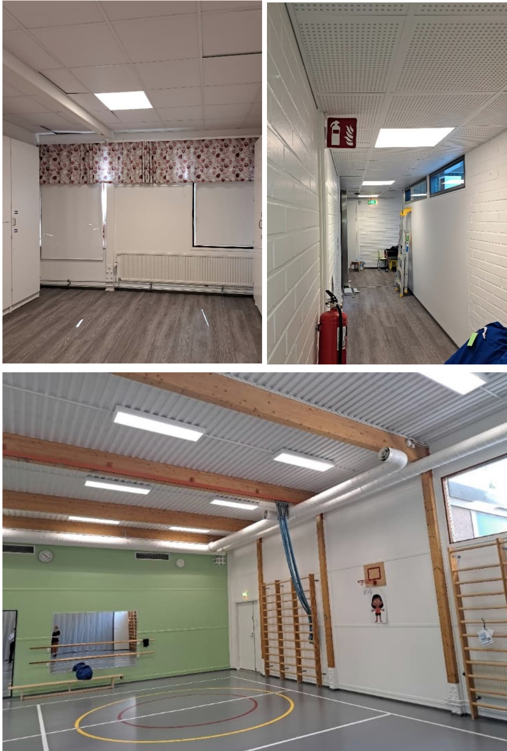
Kuva 53 a-c. Yleiskuvia rakennuksessa käytettyjen tilojen alakattotyypeistä. Pääosin tiloissa on käytetty Ewona akustiikkalevyjä.
