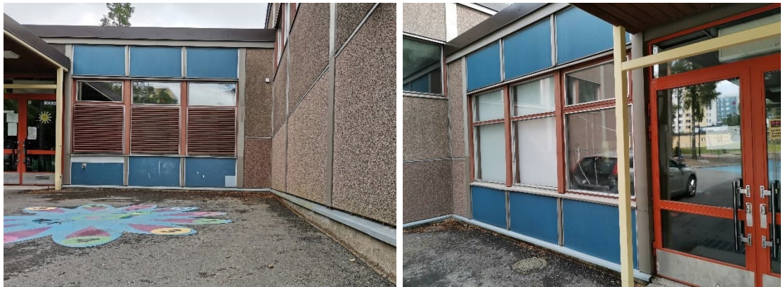
Kuva 31 a-b. Julkisivussa vanhemmat siniset julkisivulevyt olivat paikoin maalipinnaltaan kuluneita, mutta toimivia.
