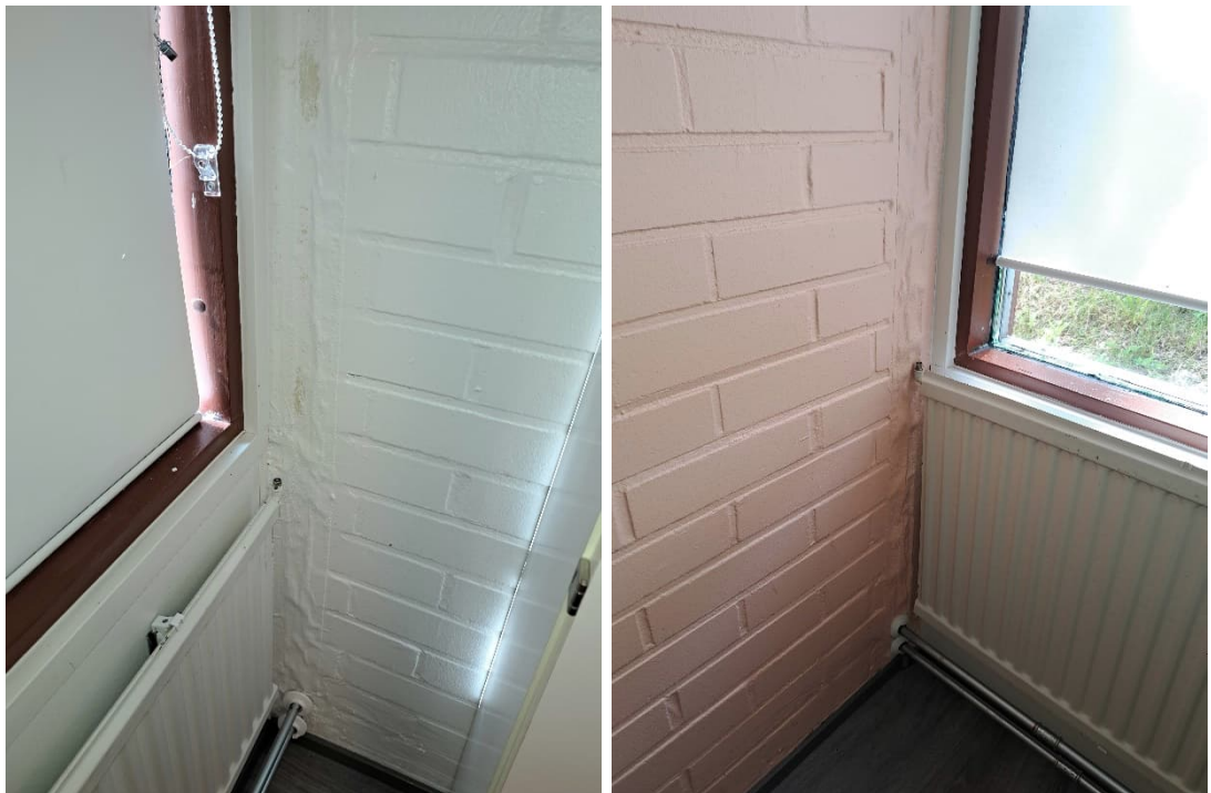
Kuva 34 a-d. Liittymiin tehdyissä tiivistyksissä havaittiin paikallisia puutteita tiivistyskaistojen asennuksessa, etenkin ulkoseiniin törmäävien tiiliseinien osalta tiivistysnauha kupruili.
