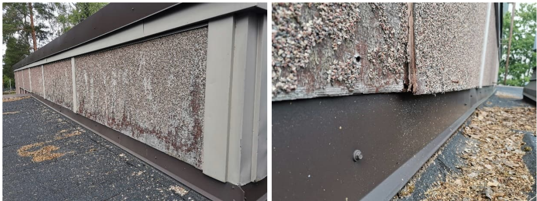
Kuva 29 a-b. Karaattilevyissä havaittiin vaurioita ja kulumaa pääosin vesikaton yläpuolelle jäävillä seinäosuuksilla.
