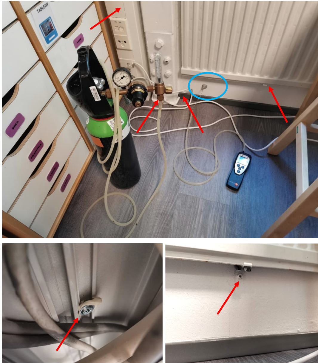
Kuva 41 a-c. Tilan 102.a ulkoseinään tehdyssä merkkiainekokeessa havaitut paikalliset vuotokohdat esitetty punaisin nuolin ja lähikuvat vuotokohdista. Kaasun syöttöpaikka merkattu sinisellä.
