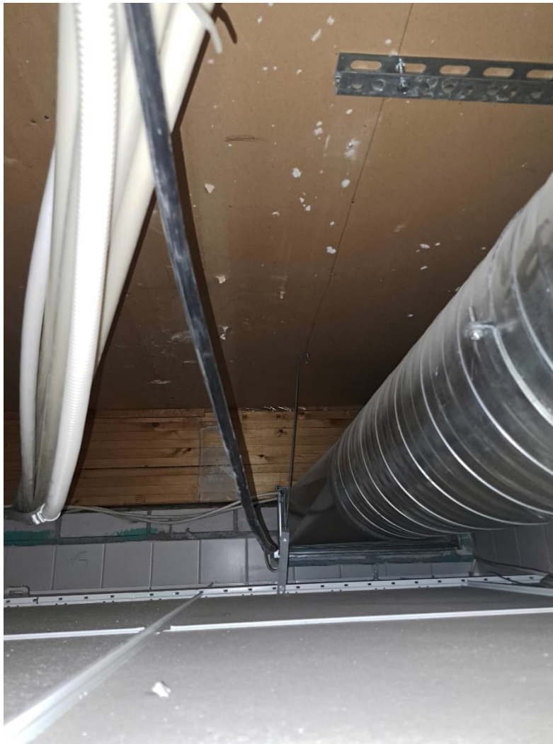
Kuva 56 a-b. Palvelukeittiön sekä IV-konehuoneen yläpohjaa ja tämän rakenneliittymiä ei ole tiivistetty ruiskutettavalla TKR-pinnoitteella kuten muut tilat.
