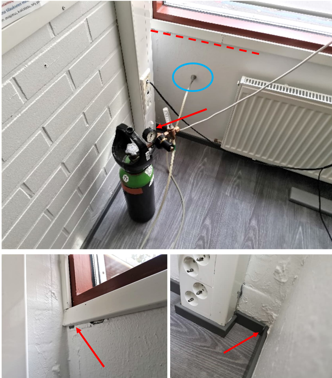
Kuva 43 a-c. Tilan 115 ulkoseinään tehdyssä merkkiainekokeessa havaitut paikalliset vuotokohdat esitetty punaisin nuolin ja lähikuvat vuotokohdista. Kaasun syöttöpaikka merkattu sinisellä.
