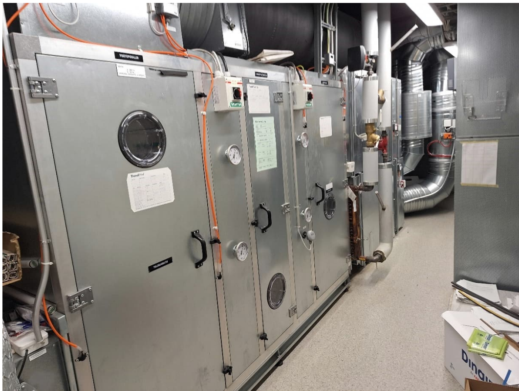
Kuva 66. Yleiskuva rakennuksen pääilmanvaihtokoneesta TK/PK02.
