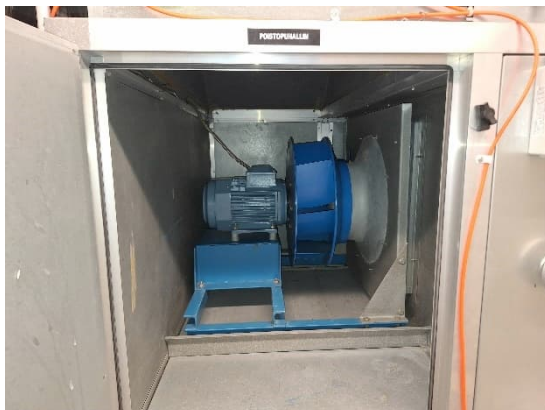
Kuva 72. Yleiskuva poistoilmapuhaltimesta. Ilmanvaihtokoneen poistoilmapuolella ei havaittu merkittäviä puutteita ja kammiot ovat yleisilmeeltään siistejä.
