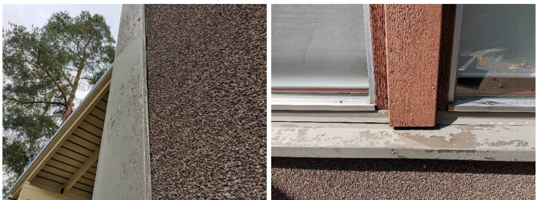
Kuva 32. Yksittäisissä julkisivulevyjen liitospellityksissä ja vaaleissa ikkunapellityksissä havaittiin maalipinnan hilseilyä.
