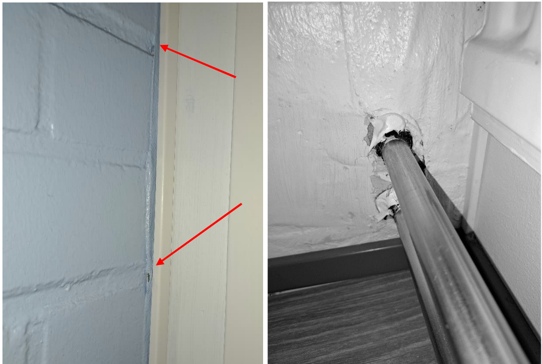
Kuva 49 a-b. Väliseinien ilmatiiveyspuutteita havaittiin pääosin ulkoseinään liittyvien seinärakenteiden ja väliseinät lävistävien läpivientien osalta.
