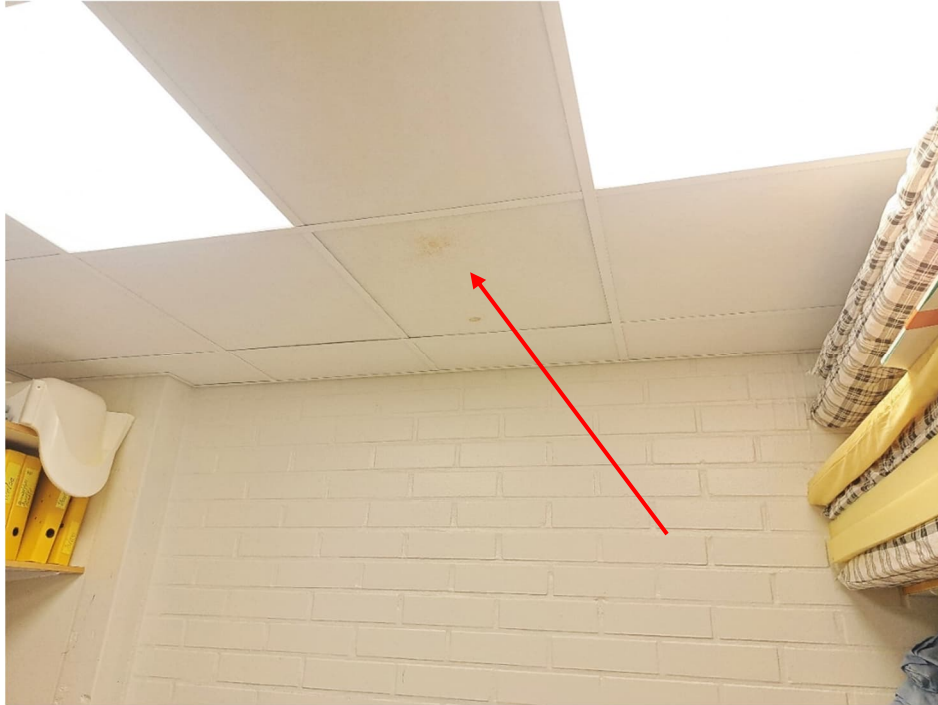
Kuva 57 a-b. Tilan 49 yläpohjasta on tullut käyttäjien mukaan vettä ennen vuoden 2020 sisäilmakorjauksia.
