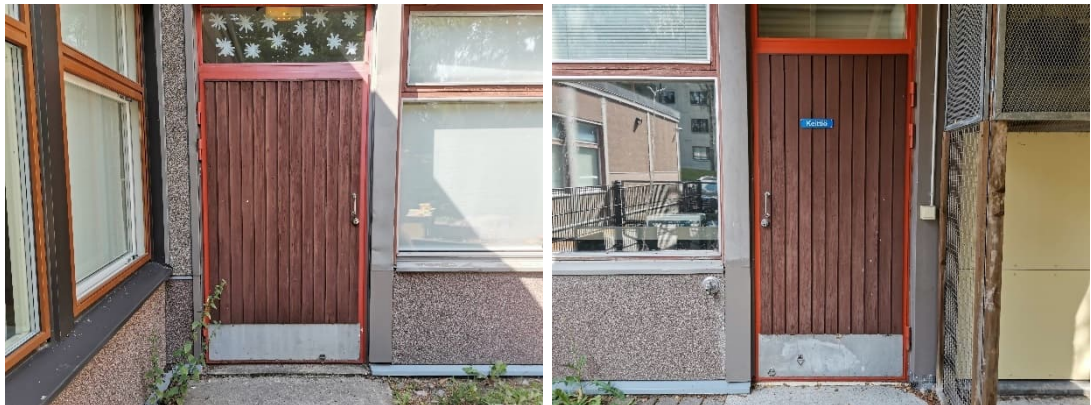
Kuva 39 a-b. Massiivipuisten ulko-ovien maalipinnoissa havaittiin kulumaa.
