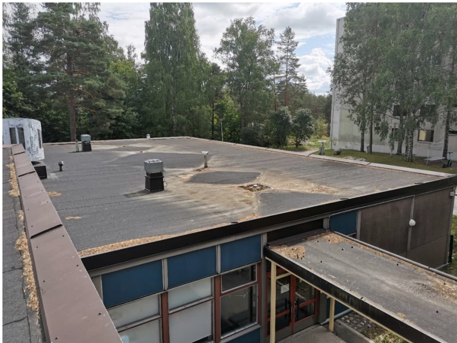
Kuva 58 a-b. Yleiskuvia lounaispäädyn vesikatosta. Katolla on havaintojen mukaan useita alueita, joihin vesi pääsee lammikoitumaan.
