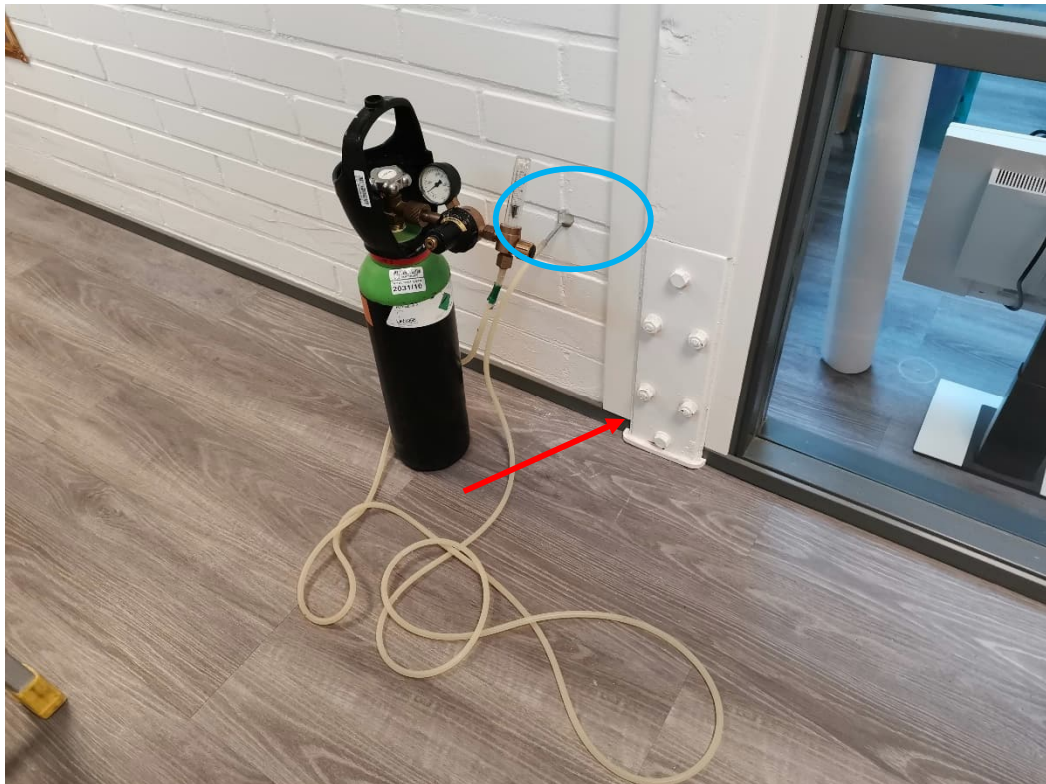
Kuva 50. Käytävän 138 ja Ryhmätilan 139 väliseinään tehdyssä merkkiainekokeessa havaitut paikalliset vuotokohdat esitetty punaisin nuolin ja lähikuvat vuotokohdista. Kaasun syöttöpaikka merkattu sinisellä.
