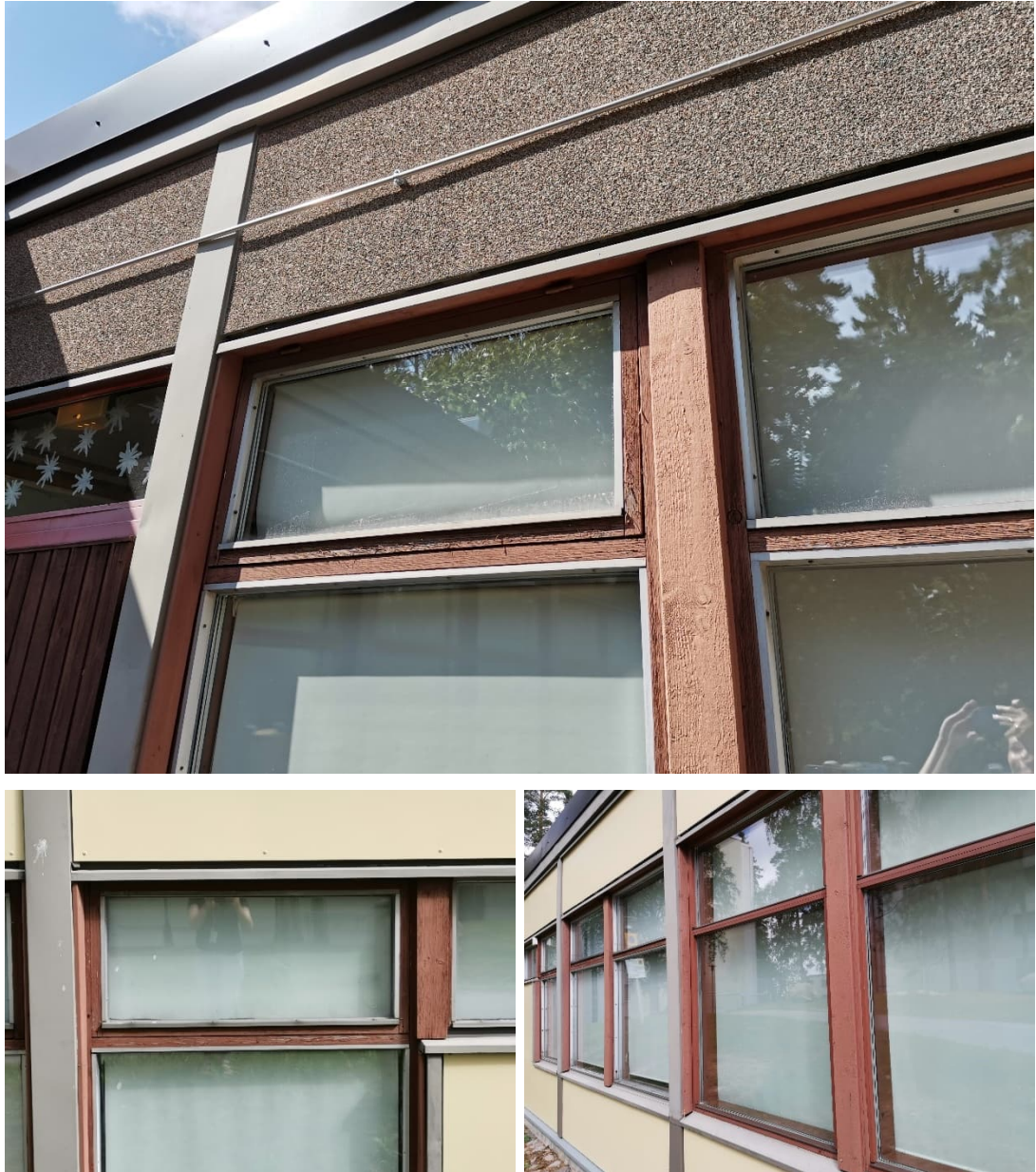
Kuva 36 a-c. Vanhojen puuelementti-ikkunoiden puuosissa havaittiin maalipintojen kulumaa ja puiden selvää lujuuden heikkenemistä / ikääntymistä. Vanhoja puuelementti-ikkunoita on uusittu paikallisesti metallirunkoisiin elementti-ikkunoihin.
