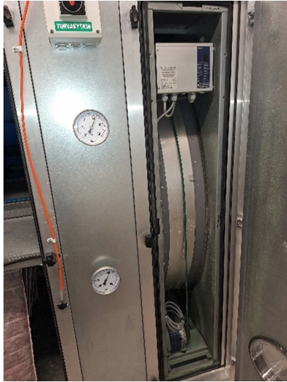
Kuva 70. Yleiskuva pyörivästä lämmöntalteenotosta. Lämmöntalteenotto-kammio on yleisilmeeltään siisti.
