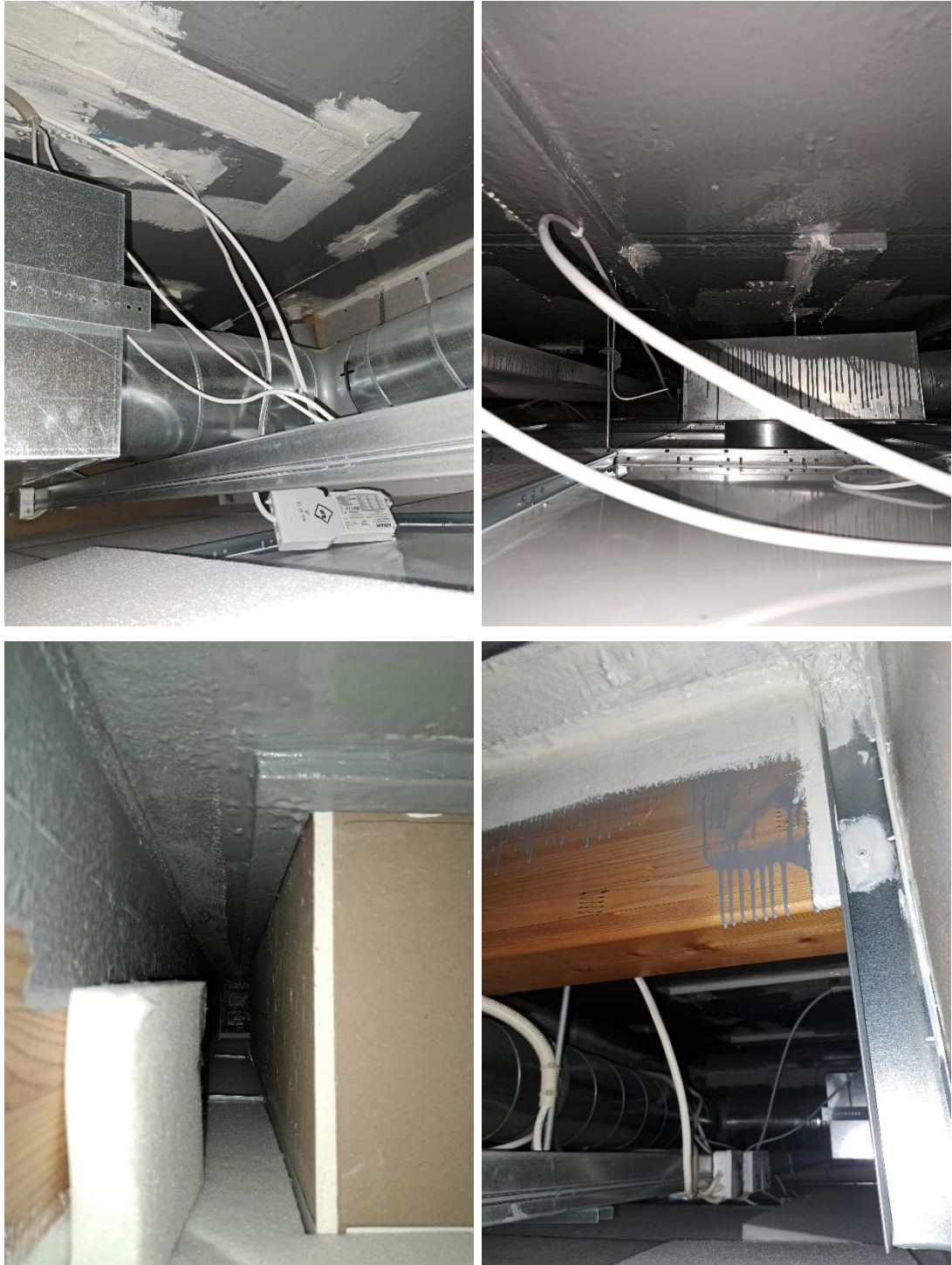
Kuva 54 a-d. Katon levypinnat, sekä kattopalkkien ja seinien rakenneliittymät on tiivistetty ruiskutettavalla TRK-pinnoitteella ja saumanauhalla. Tiivistykset olivat aistinvaraisesti tarkasteltuna pääosin asianmukaiset ja tiiviit.
