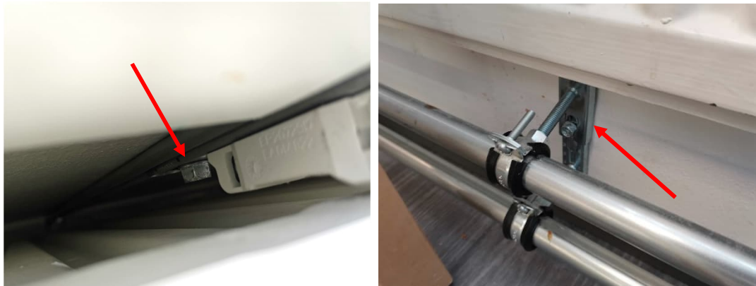
Kuva 44 a-e. Tilan 124.a ulkoseinään tehdyssä merkkiainekokeessa havaitut paikalliset vuotokohdat esitetty punaisin nuolin ja lähikuvat vuotokohdista. Kaasun syöttöpaikka merkattu sinisellä.
