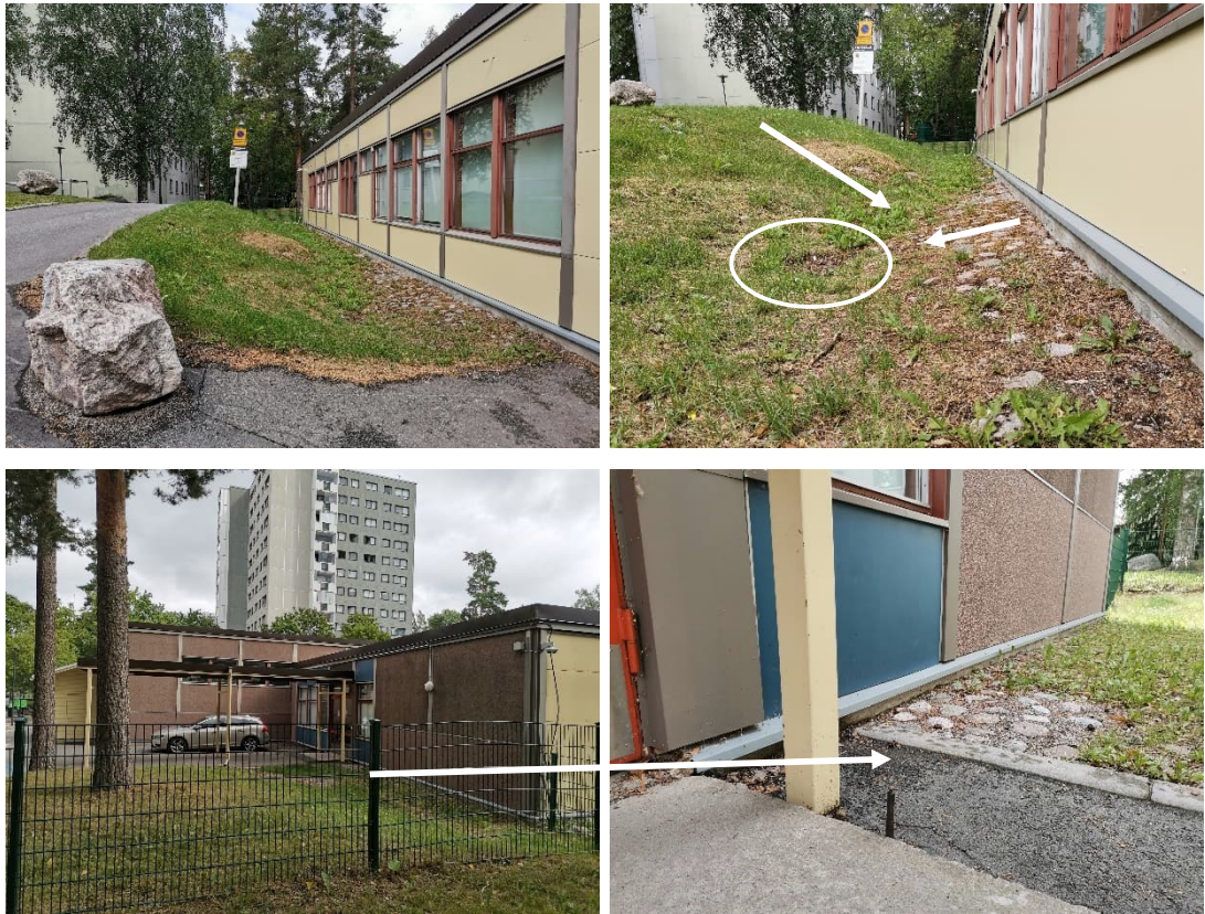
Kuva 7 a-d. Lounaispuoleinen nurmialue kallistaa loivasti ns. "niskaojaan". Kaivo on lähes tukkeessa ja sokkelin vierustan mukulakiveys painunut kasvillisuuden sekaan. Luoteispuoleisella seinustalla maanpinta nousee lähes sokkelin yläreunan tasolle ja on melko tasainen.
