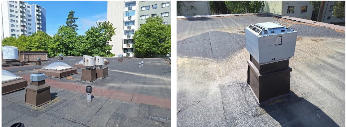
Kuva 73. Yleiskuvat vesikatolla sijaitsevista erillispuhaltimista.
