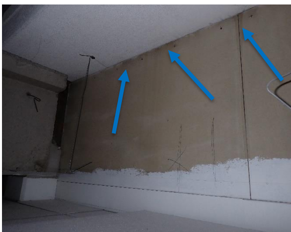
Kuva 31 Ulkoseinärakenteen levytyksessä on nähtävissä useita vuotojälkiä käytävän 201 kohdalla.
