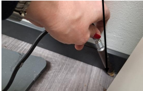
Kohtalaista vuotoa alapohjan ja ulkoseinän rajalla.
