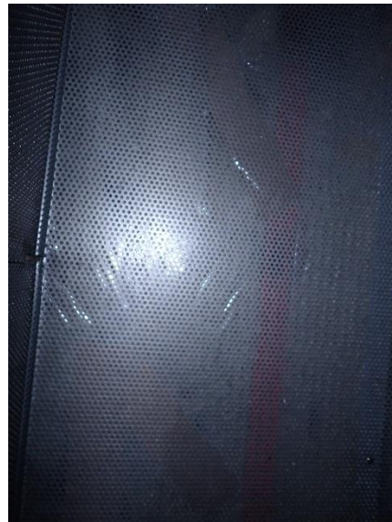
Kuva 69 Tuloilmakammiossa on reikäpelti ja sen alla muovilla pinnoitettu mineraalivilla.
