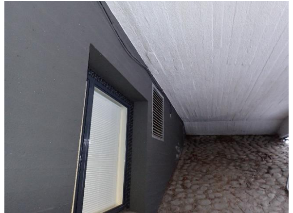
Kuva 92 Ilmanvaihtokoneen TK-5 ulkoilmanotto tapahtuu katoksesta.
