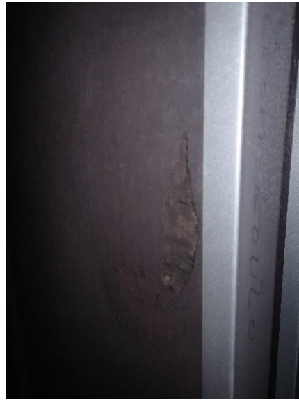
Kuva 67 Lamelliäänenvaimentimien pinnoite on rikkoutunut.
