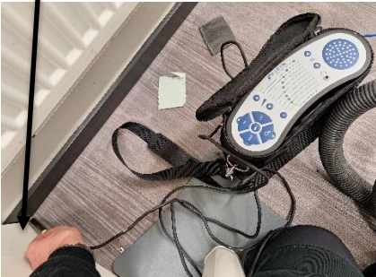
Lievää vuotoa alapohjan ja ulkoseinän rajalla.
