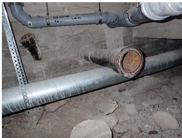
Kuva 12 Ryömintätiloissa on käytöstä poistettuja katkaistuja viemäriin putken päitä.
