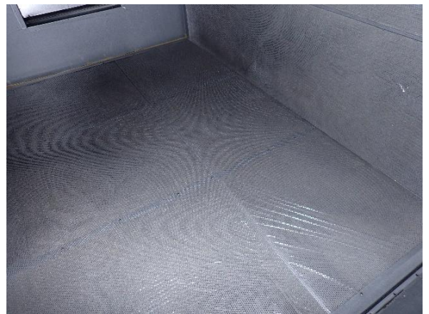
Kuva 74 Tuloilmakammiossa on reikäpelti ja sen alla muovilla pinnoitettu mineraalivilla.
