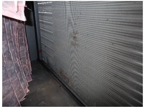
Kuva 72 LTO-patterin pinnalla on siitepölyä ja muuta epäpuhtautta.
