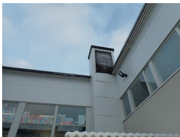
Kuva 78 TK-3 ja TK-4 ulkoilmanotto.
