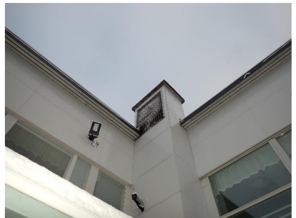
Kuva 60 TK-1 ja TK-2 ulkoilmanotto.
