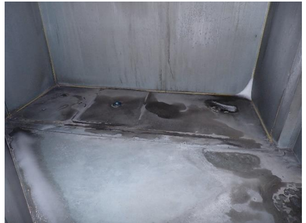
Kuva 84 Raitisilmakammiossa havaittiin kosteutta ja lunta.
