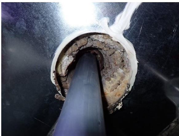
Kuva 11 Läpiviennit eivät ole ryömintätilan puolelta tiiviitä.
