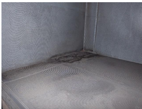
Kuva 79 Raitisilmakammiossa on lunta ja suojaamatonta mineraalivillaa.
