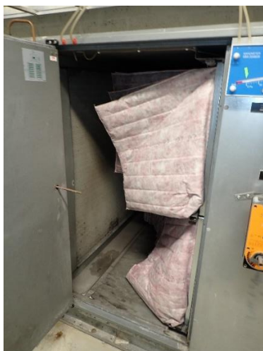
Kuva 63 Tuloilmasuodattimissa oli tutkimushetkellä lunta.
