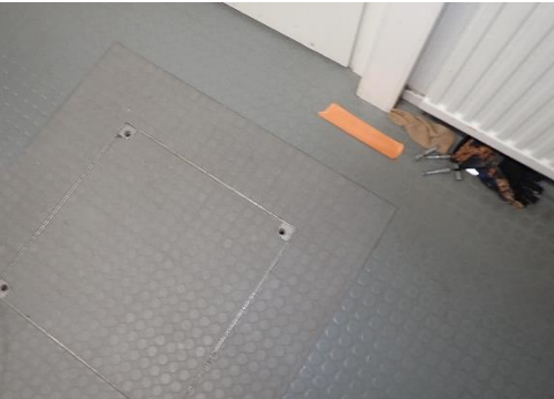
Selkeää vuotoa sähköläpiviennin kohdalla.
