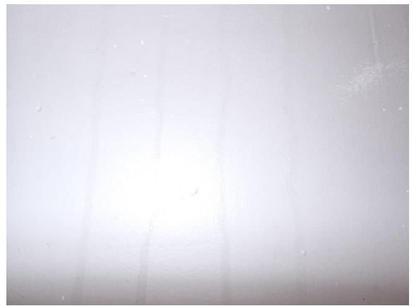
Kuva 64 Ulkoseinässä oli havaittavissa valumajälkeä.
