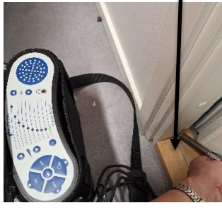
Lievää vuotoa tilojen välisen oven liitoskohdassa.
