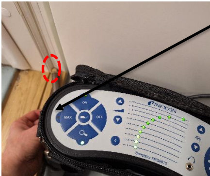
Selvää vuotoa oven kynnyksen kohdalla.
