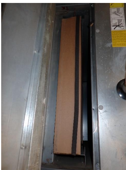
Kuva 75 PK-2.1 poistoilmasuodattimena on ka-settisuodatin.
