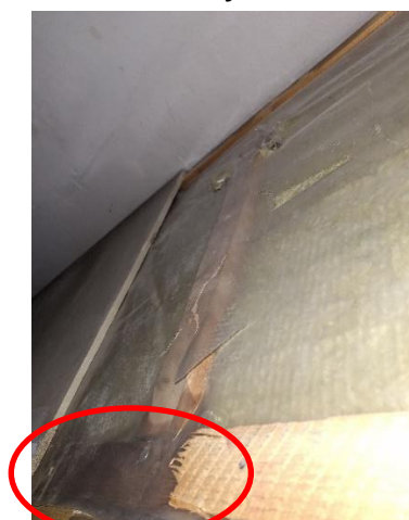
Kuva 32 Käytävällä 257 ulkoseinärakenteessa puurangassa oli selkeitä kosteusjälkiä.
