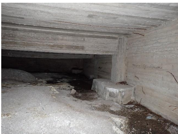
Kuva 13 Rakennuksen eteläpäässä ryömintättilassa on kosteampi alue.
