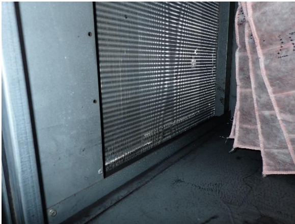
Kuva 93 Lämmityspatterissa ei havaittu merkittävää likaantumista.
