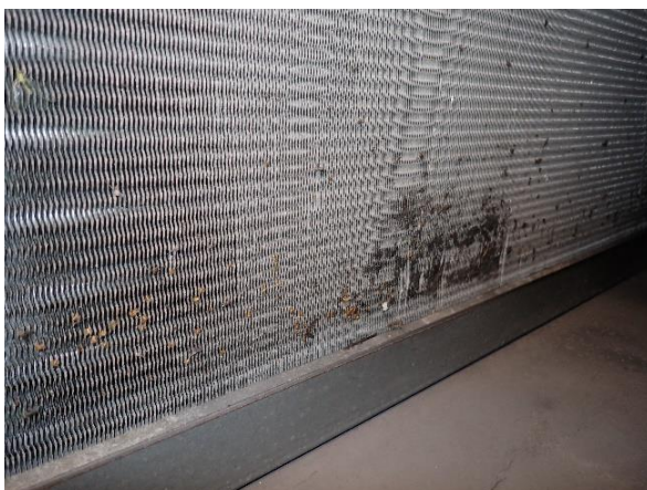
Kuva 65 LTO-patterin pinnalla on siitepölyä ja muuta epäpuhtautta.
