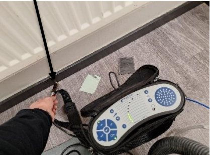
Selvää vuotoa alapohjan ja ulkoseinän rajalla.
