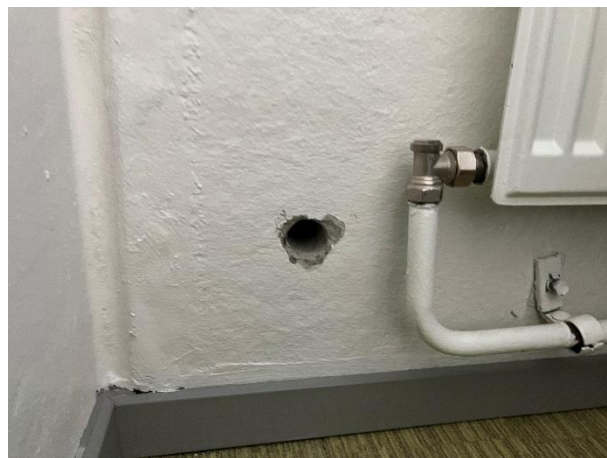
Kuva 4. Rakenneavauksen kautta otettiin materiaalinäytteitä mikrobimääritystä varten. Rakenneavauksesta kulkeutui sisätiloihin mikrobiperäistä hajua.
