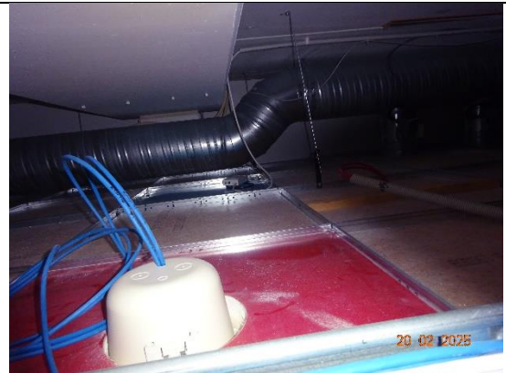
Kuva 11. Alakaton yläpuolistatilaa ope- tustilassa 2221. Pölyä havaittavissa levyn pinnalla.
