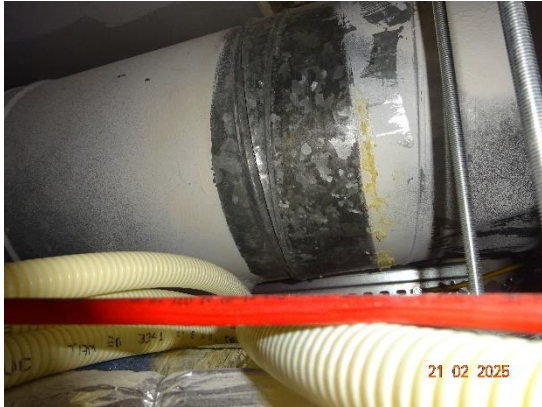
Kuva 8. Kotitalousluokan 1232–1234 alakaton päällä olevaa tekniikkaa.
