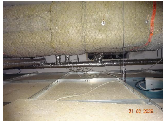
Kuva 7. Näkymä ruokalasta 1212 keittiöön 1217 päin. IV-kanavan päällä on muovi.
