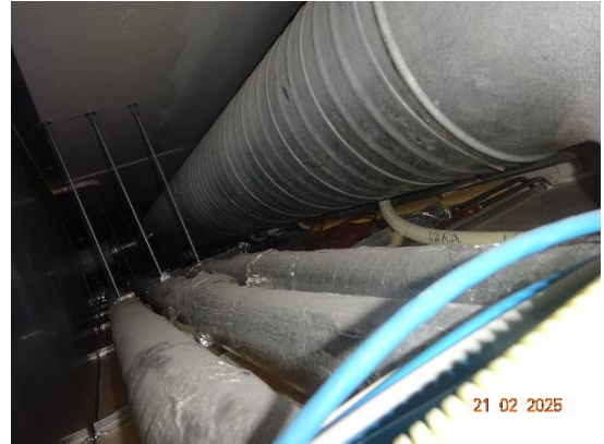
Kuva 9. Kotitalousluokan 1232–1224 alakaton päällä olevien putkien pinnalla pölyä.
