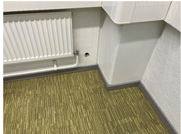
Kuva 6. Rakenneavauksen kautta otettiin materiaalinäytteitä mikrobimääritystä varten. Rakenneavauksesta kulkeutui sisätiloihin mikrobiperäistä hajua.
