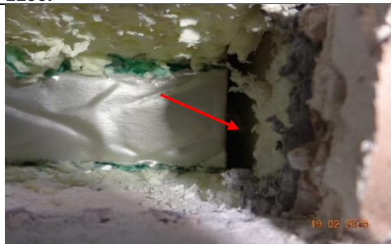
Kuva 3. Apukarmin ja uretaanilevyn välissä on noin 10 mm rakko.
