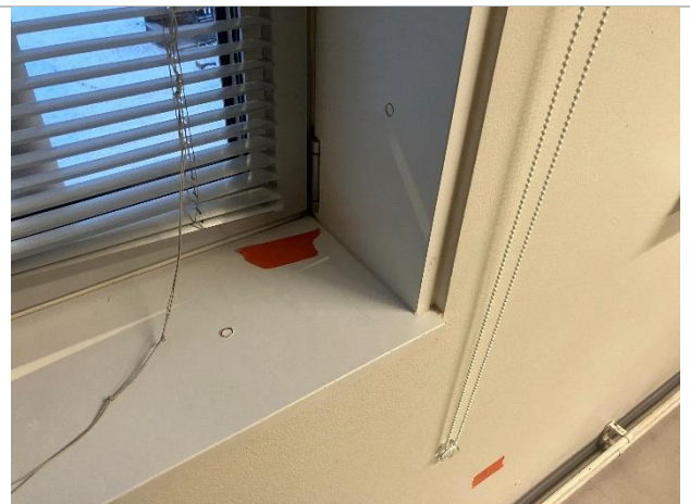
Kuva 31. Ikkunapenkin takaa pistemäistä vuotoa. Kyseinen kohta vuoti myös ilman alipaineistusta.
