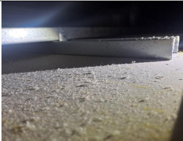
Kuva 20. Alakattolevyn yläpinnassa on paikoin runsaasti pölyä/likaa.
