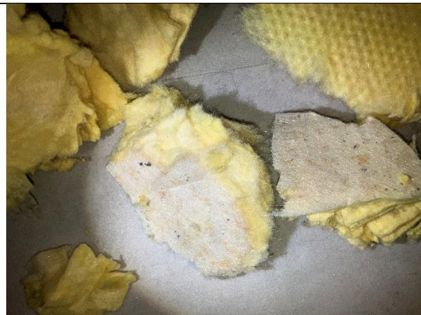
Kuva 27. Rakenneavauksista US 1 ja US 2 havaittiin lämmöneristeen ulkopinnassa lievää värjäytymää.
