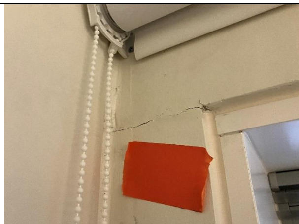
Kuva 33. Ulkoseinän nurkan halkeamasta havaittiin merkittävää vuotoa alipaineistettuna.
