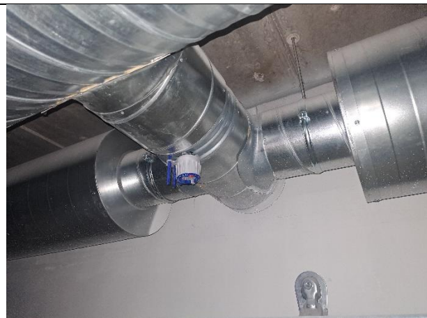
Kuva 34. Tuloilmakanavistoa alas lasketun katon yläpuolella äänenvaimentiminen ja säätöpelteineen.
