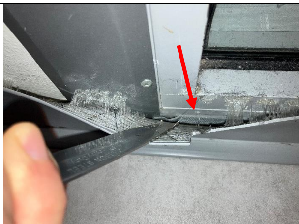
Kuva 9. Käytävän 2.021 jalkalistan takana havaittavissa butyylinauhaa.
