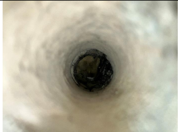
Kuva 26. Rakenneavaus RA3-US ikkunan yläpuolella. Betonin sisäkuoren ulkopinnassa havaittiin bitumikermi.
