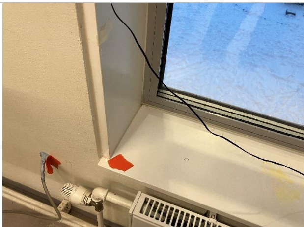
Kuva 30. Ikkunapenkin takaa pistemäistä vuotoa. Kyseinen kohta vuoti myös ilman alipaineistusta.
