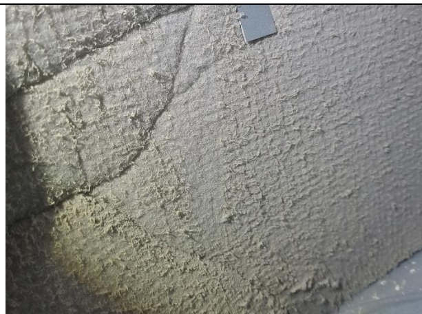
Kuva 35. Pölykertymää poistoilmalaitteen äänieristyslevyssä
