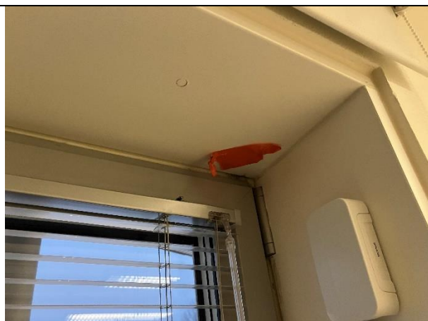
Kuva 32. Ikkunan ja ulkoseinän liittymästä havaittiin pistemäistä vuotoa alipaineistettuna.
