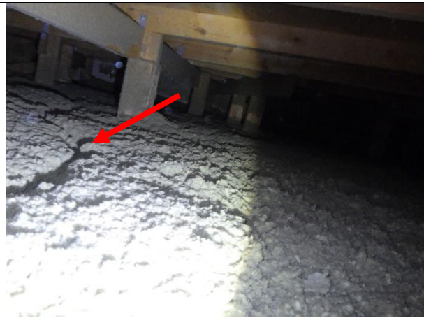
Kuva 16. Yläpohjatileä tilan 2.087 kohdalta. Etualla havaittavissa jyrsijöiden jälkiä.
