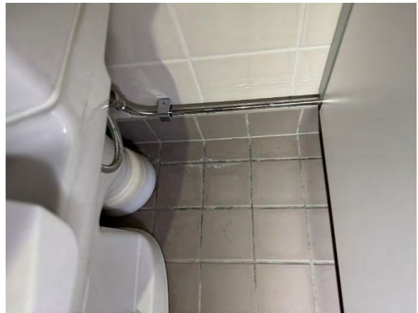
Kuva 23. Yksittäisissä WC-tiloissa pesuvesiä kertyy lattialle kallistuspuutteiden takia.
