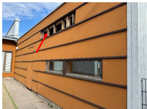
Kuva 39. Kylmien varastojen kohdalla julkisivulevytykset ovat kosteus- ja lahovaurioituneet. Yksi levytys on kokonaan irronnut ja pudonnut maahan.
