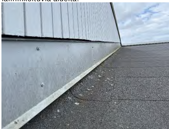
Kuva 72. Päävesikatolla on vähäistä sammal- / jäkäläkasvustoa.
