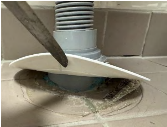
Kuva 22. WC- ja pesutilan 130 viemärin liitos lattiaan ei ole vesitiivis.
