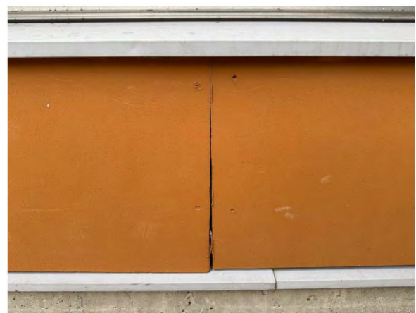
Kuva 41. Vanhoilla vaneripintaisilla seinäosuuksilla levyverhousten jatkokset ja limitykset eivät ole vesitiiviitä.
