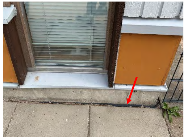
Kuva 7. Sokkelin ulkopintaan on jälkikäteen asennettu perusmuurilevytyks.
