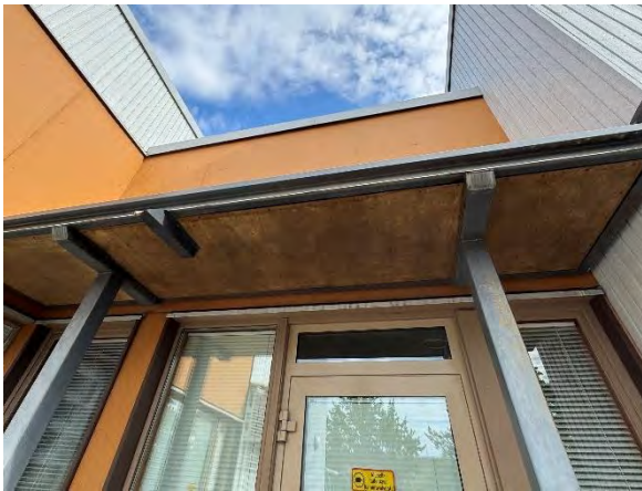
Kuva 80. Katosten alapinnan levytyksiin on kosteuden kondensoitumisen seurauksena muodostunut näkyviä kosteusvaurioita.
