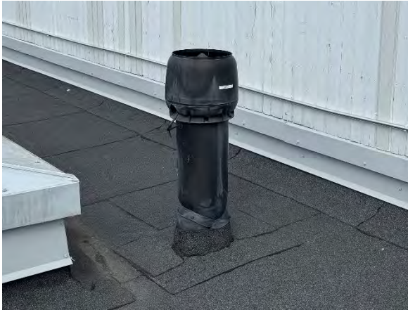
Kuva 74. Vesikatolle on jälkikäteen asennettu huippumurit alapohjan tuuletusta varten.
