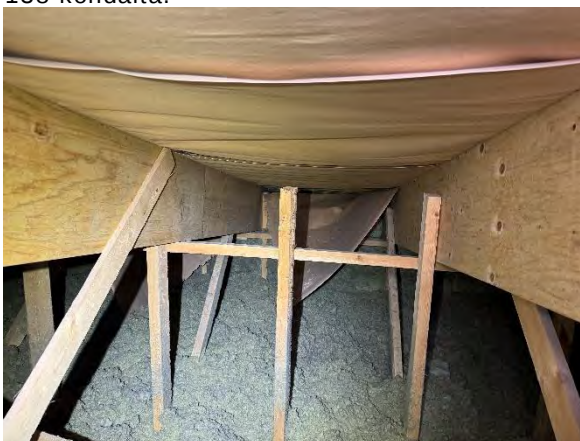
Kuva 68. Yksittäiseen yläpohjatilaan on lisätty eristeeksi puhallusvillaa. Puhallusvilla on osittain tukkinut räystästuuletusta. Lisäksi aluskate on räystäään läheisyydestä repeytynyt.
