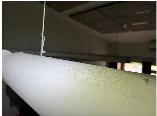
Kuva 86. Valaisimien päällä havaittiin vähäistä pölykertymää. Kuva ryhmähuoneesta 109.
