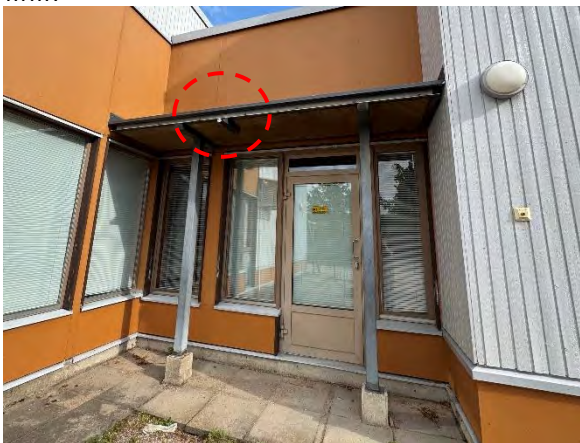
Kuva 8. Eteläpuolella olevien yksittäisten kastosten sadevedet ohjautuvat suoraan piha-alueelle, mutta ei sokkelin vierustalle.
