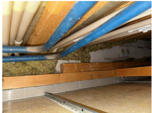
Kuva 84. Alakatossa on pinnoittamatonta mineraalivillaa WC-tilassa 122A.
