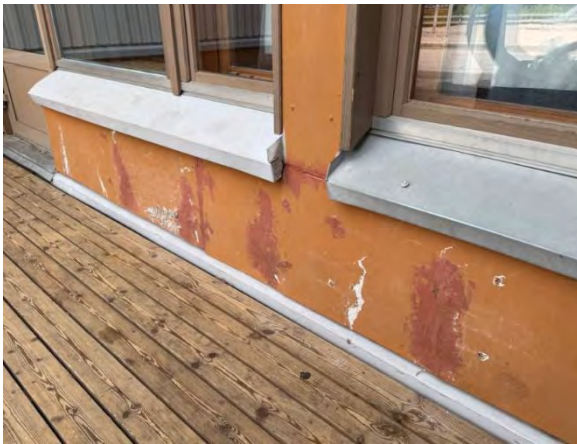
Kuva 40. Julkisivun levyverhouksen alaosa on valokatetun terassin kohdalla mekaanisia vauriojälkiä.
