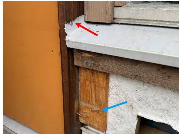
Kuva 43. Yksittäisten ikkunoiden kohdilla vesipellitykset on tuotu peitelaudoituksen päälle, jolloin vettä pääsee kulkeutumaan ulkoseinärakenteeseen (punainen nuoli). Ikkunan alapuolissa puurakenteessa on tästä johtuen kosteusjälkiä (sininen nuoli).
