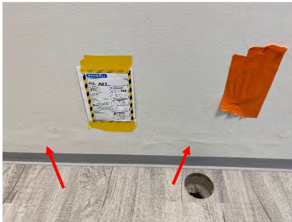
Kuva 55. Kosteusjälkiä väliseinän alaosaan käytävällä 138.
