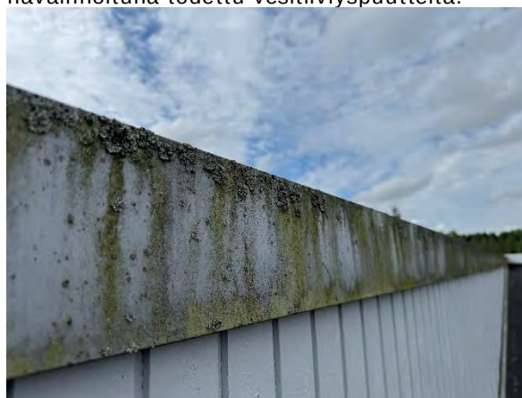
Kuva 73. Räystäspellityksissä on paikoitellen likakertymää ja sammal- / jäkäläkasvustoa.
