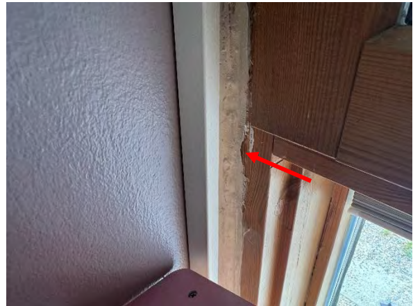
Kuva 37. Ennen vuotta 2023 tehdyt ikkunatiivistykset on toteutettu tiivistysmassan ja vahvikekankaan avulla. Vahvikekangas on paikoitellen irronnut alustastaan. Kuva tilasta 121A.
