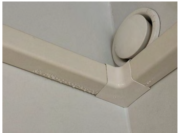
Kuva 54. Kondensoitunutta kosteutta ilma-lämpöpumpun kylmäaineputkiston ulkopin-nassa tilassa 129A.
