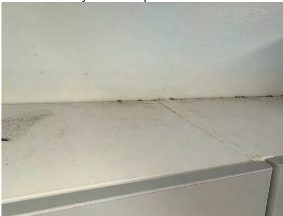
Kuva 85. Korkeiden kaappien päällä on jonkin verran pölykertymää. Pölymäärän perusteella kaappien päällisten pyyhkiminen ei kuulu säännöllisen siivouksen piiriin. Kuva ryhmähuoneesta 121.
