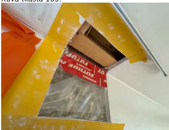
Kuva 38. Rakenneavaus RA-US 9b. Seinien yläosista höyrynsulkumuovia ei ole uusittu. Vanhojen höyrynsulkumuovien liitokset ovat joko teippaamatta kokonaan tai teipattu pakkausteipillä.
