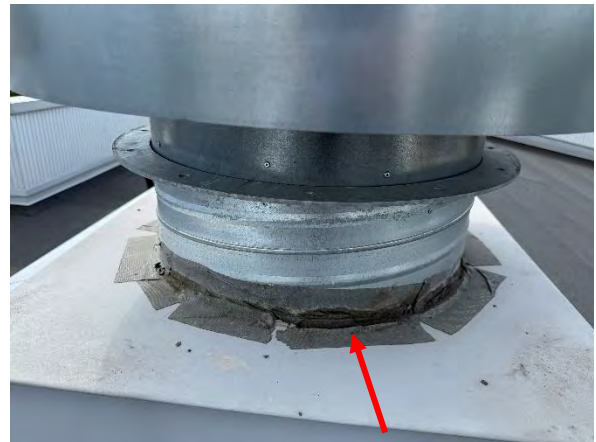
Kuva 77. IV-läpiviennin liitos kanavaan ei ole aistinvaraisesti arvioituna vesitiivis.
