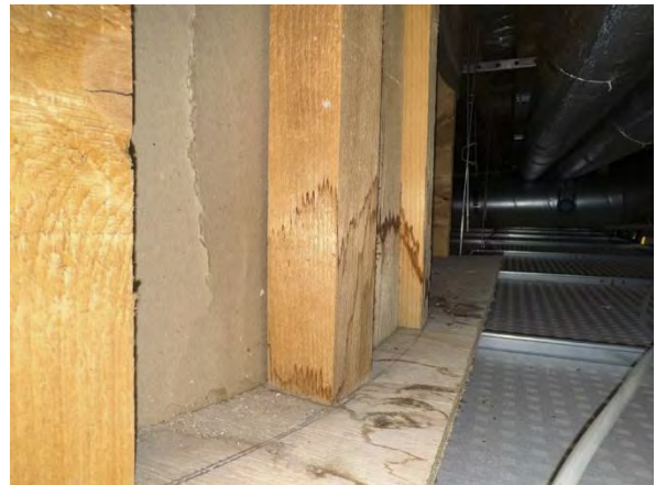
Kuva 67. Kattoikkunan ympärillä on kuivuneita kosteusjälkiä. Kuva rakenneavauksen RA-YP 3 kohdalta aulasta / ruokailutilasta 138.
