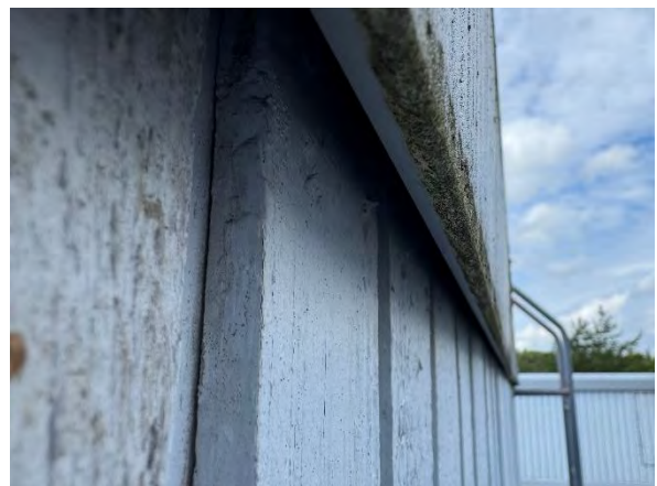
Kuva 69. Räystääspellitusten ja seinärakenteen välissä oleva rako on paikoitellen kapea, mikä heikentää yläpohjatilaa tuulettuvuutta.
