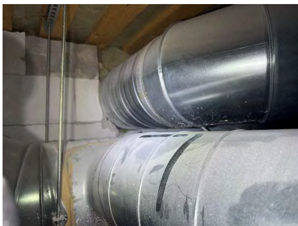
Kuva 81. Alakatossa olevien kanavien päällä on runsasta pöly- ja likakertymää. Kuva varastosta 133.
