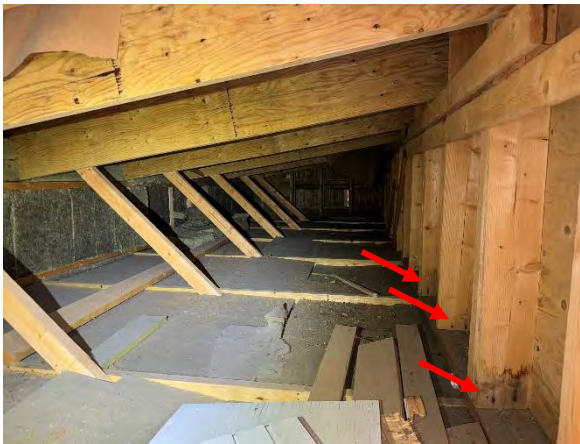
Kuva 64. Pystyrungon alaosissa on kosteusvauriojälkiä (punainen nuoli). Ulkopuolella ei havaittu vesitiiviyspuutteita, joten jäljet ovat vanhoja, ja aiheutuneet ennen vesikatteiden uusimista.
