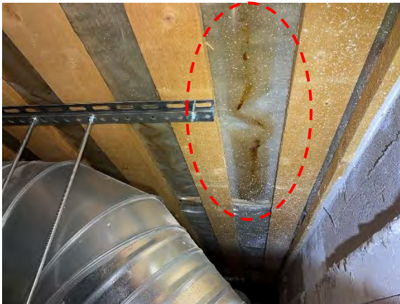
Kuva 66. Yläpohjan eristeen alapinnassa on jyrsijöiden jätöksiä. Höyrynsulun yläpinnalla on lisäksi kuivuneita kosteusjälkiä. Kuva käytävän 138 kohdalta.
