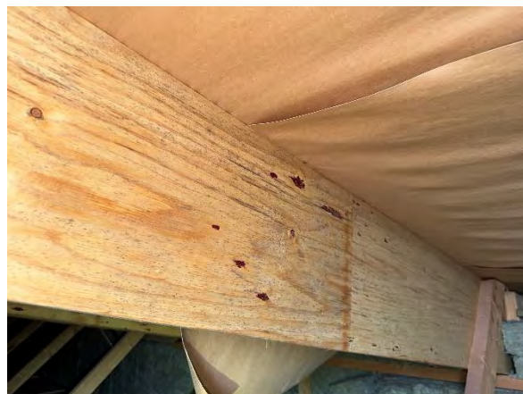
Kuva 63. Puurakenteissa havaittiin näkyvää, pilkullista mikrobikasvustoa sekä vanhoja kuivuneita kosteusjälkiä.
