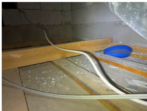
Kuva 82. Alakaton päällä on rakennusjätettä. Kuva varastosta 133.
