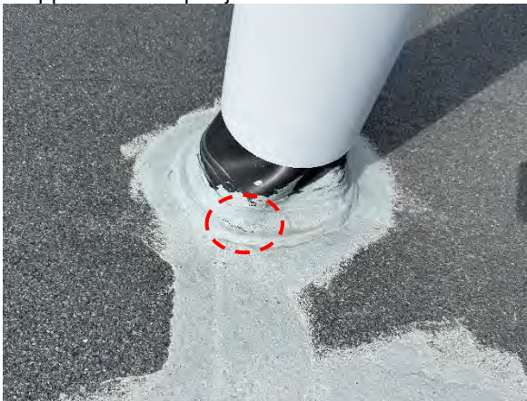
Kuva 76. Tuuletusputken läpiviennin tiivistyksessä on reikä.
