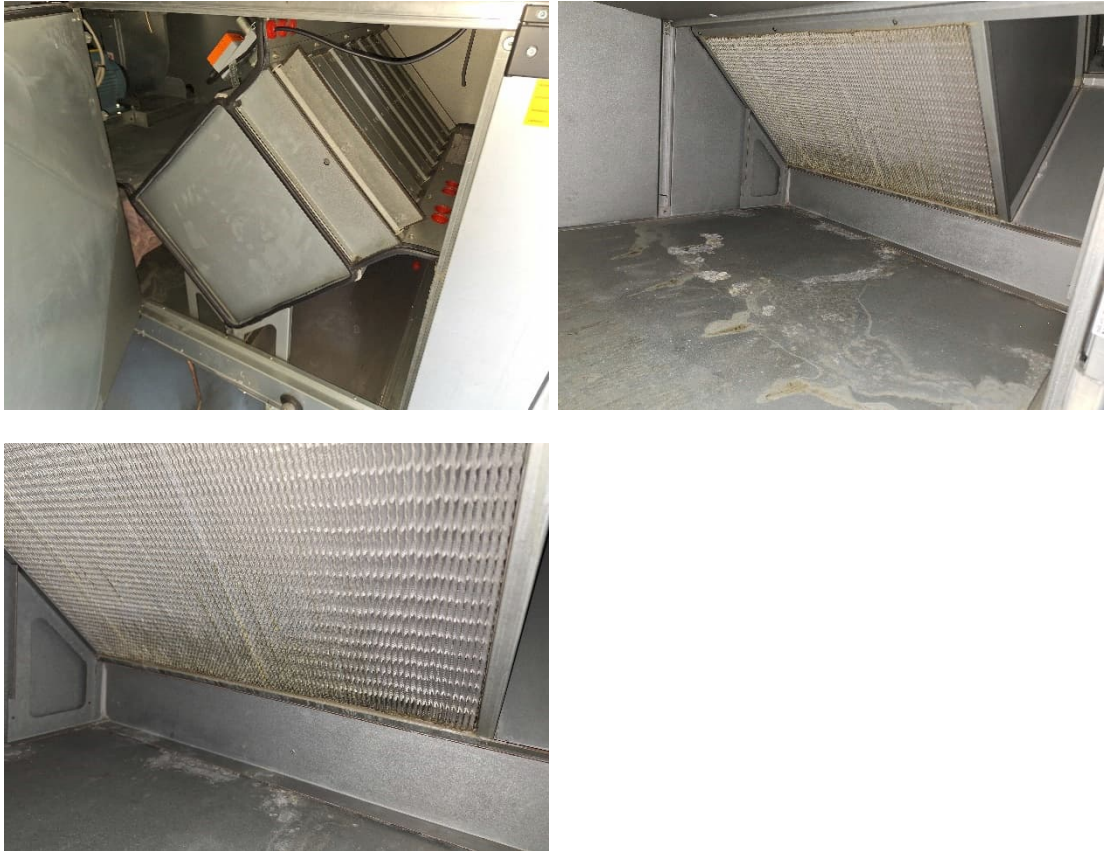
Kuva 54. Yleiskuvat ilmanvaihtokoneen LTO-kuutiosta. Kammion pohjalla on vanhoja kosteusjälkiä sekä LTO-kennossa valumajälkiä.
