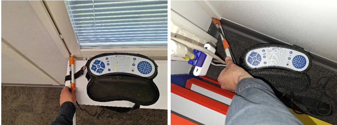
Kuva 32. Merkkiainevuotoa havaittiin myös ikkunaliittymistä sekä tilaelementtien saumojen kohdalta. Merkkiainevuotoja havaittiin opetustiloissa 03, 05 ja 06.
