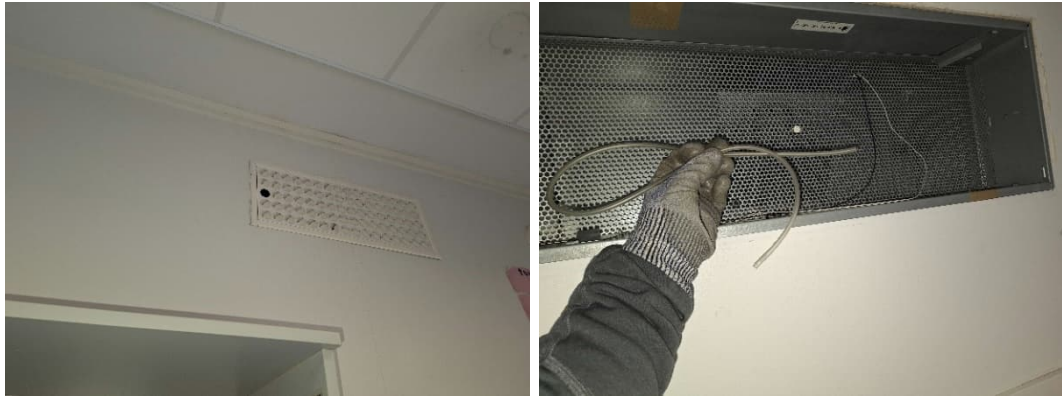
Kuva 63. Yleiskuvat tuloilmapäätelaitteista. Osassa tiloissa tuloilmapäätelaitteiden ilmavirran suuntaussuuttimia puuttuu tai ne olivat rikki. Yksittäisissä tiloissa tuloilmapäätelaitteiden ilmavirran mittausetkut olivat irti.
