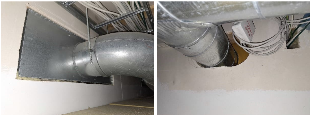
Kuva 35. Käytävän puolelta tarkasteltuna väliseiniä läpiviennit ovat avoimia eikä niitä ole tiivistetty. Luokkatilojen puolelta liittymät on tiivistetty massaamalla.
