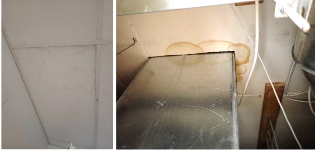
Kuva 48. Akustolevyissä käytävällä on paikallisesti vesijälkiä Yläpohjan IV-läpiviennin (WC-tilojen koneellisen poiston huippuimuri) ympärillä havaittiin kosteusjälkiä.
