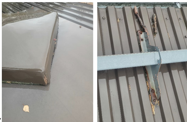
Kuva 39. Kattoluukku on kulmistaan haljennut. Lumiesteiden kiinnikkeissä on ruostetta.
