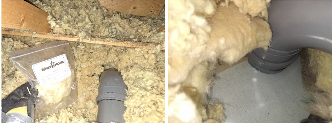
Kuva 50. Yläpohjan materiaalinäyte L18 otettiin viemärin tuuletusputken juuresta. Materiaalinäytteessä ei ole mikrobikasvustoa. Putken läpivienttiä ei ole tiivistetty. Läpiviennin ympärillä mineraalivillassa on ilmavirtausten aiheuttamaa tummentumaa.
