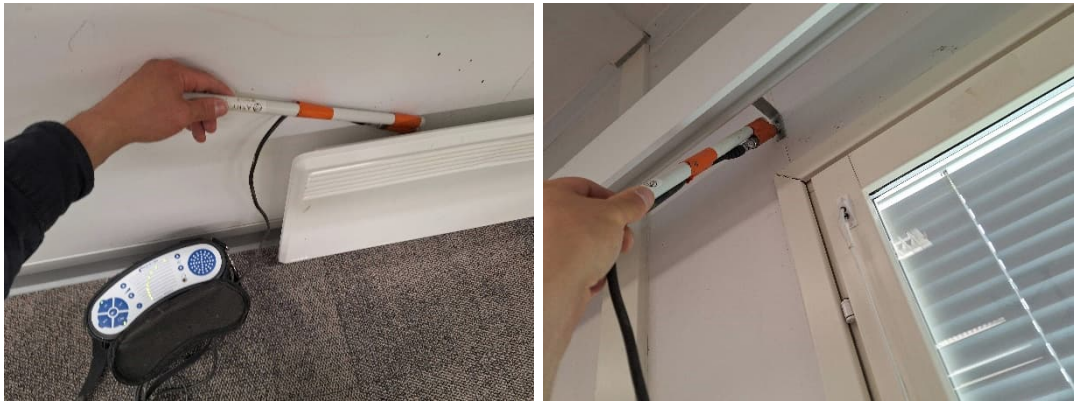
Kuva 31. Tilojen ollessa alipaineistettuja merkkiainevuotoa havaittiin patterikannakkeiden sekä verhojen kannakkeiden kohdalta.
