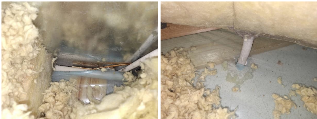
Kuva 45. Yläpohjan höyrynsulku ei ole tiivis. Läpiviennit ovat tiivistämättä.
