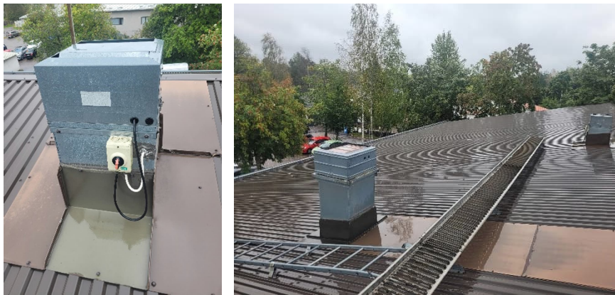
Kuva 59. Yleiskuva erillispoistopuhaltimista vesikatolla.
