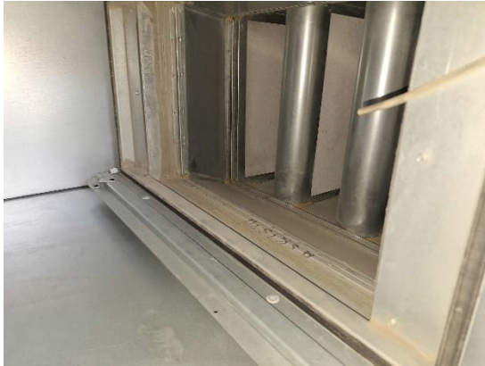
Kuva 56. Yleiskuva ilmanvaihtokoneen äänenvaimentimista. Äänenvaimentimissa ei havaittu mineraalivillakuitulähteitä.
