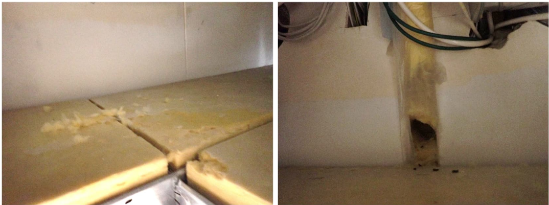
Kuva 47. Rakennuksen sisätiloissa on havaittu hiiriä. Hiiret kulkevat todennäköisesti tilaelementtien saumoissa. Kuvissa hiirien jättämiä jälkiä käytävän alakattotilassa. Akustiikkalevyjä on syöty rikki. Lisäksi akustolevyjen reunoja ei ole käsitelty. Avoimet villapinnat toimivat sisäilman kuitulähteinä.
