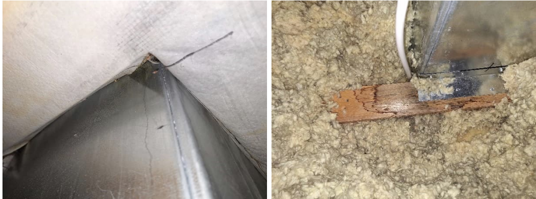
Kuva 44. Vesikaton IV-läpivienti vuotaa. Kyseisen ilmanvaihtokanavan yläpohjan läpiviennin ympärillä on kosteusvauriojälkiä puurakenteissa. Läpiviennin kohdalta otetussa materiaalinäytteessä on mikrobikasvustoa.
