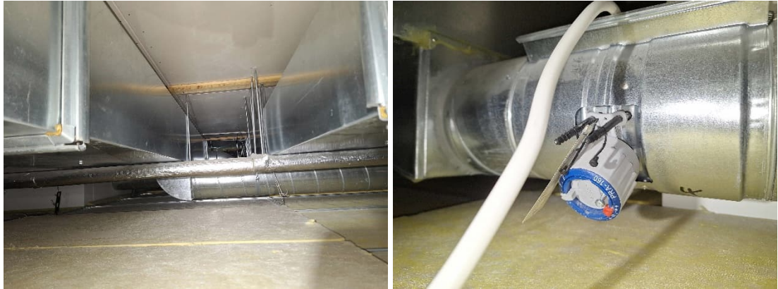
Kuva 60. Yleiskuvia ilmanvaihtokanavistosta. Kanavistossa on PRA -ilmamääräsäätimiä rakennusvuodelta 2000.
