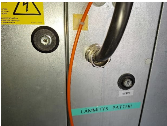
Kuva 58. Ilmanvaihtokoneen rungossa havaittiin avoimia läpivientejä, jossa oli selkeä ilmavirta ja ohivuoto.
