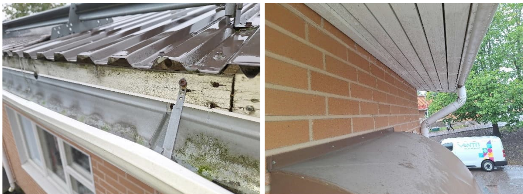
Kuva 42. Otsalautoissa on alkavaa lahoa otsalautoituksen jatkoskohdassa sekä sadevesikourun kiinnikkeiden kohdalla. Räystään aluslaudoitukset ovat hyväkuntoiset.
