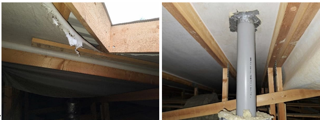
Kuva 43. Vesikaton aluskatteen läpiviennit ja liittymät on pääosin toteutettu puutteellisesti. Aluskate on myös asennettu liian kireälle.
