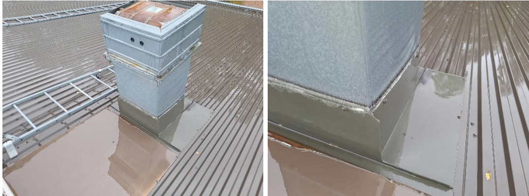
Kuva 40. Vesikatossa havaittiin yksi vuotokohta IV-läpiviennin kohdalta.
