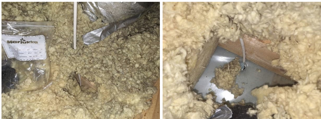
Kuva 51. Materiaalinäyte L19 otettiin käytävän kohdalta IV-läpiviennin läheisyydestä, sähköläpiviennin juurelta. Materiaalinäytteessä on laboratorion analyysinvastauksen mukana mikrobikasvustoa. Sähköläpiviennin kohdalla höyrynsulku ei ole tiivis.
