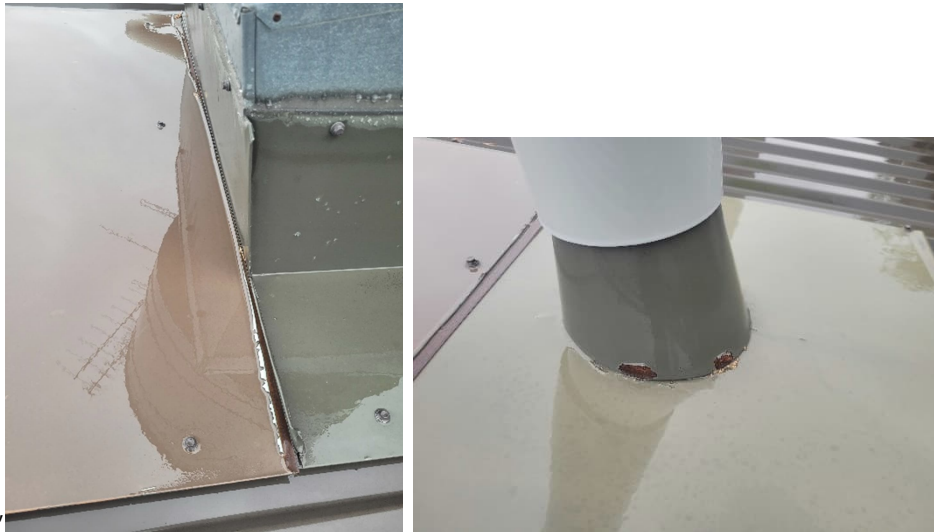
Kuva 41. Pellitysten saumoissa ja läpivienneissä esiintyy vaurioita.
