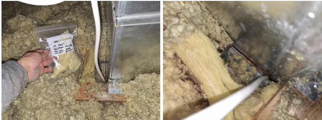
Kuva 49. Yläpohjan materiaalinäyte L1 otettiin käytävän IV-läpiviennin juuresta. Näytteenottokohdalla on vesivuotojälkiä. Materiaalinäytteessä on analyysivastauksen perusteella mikrobikasvustoa.
