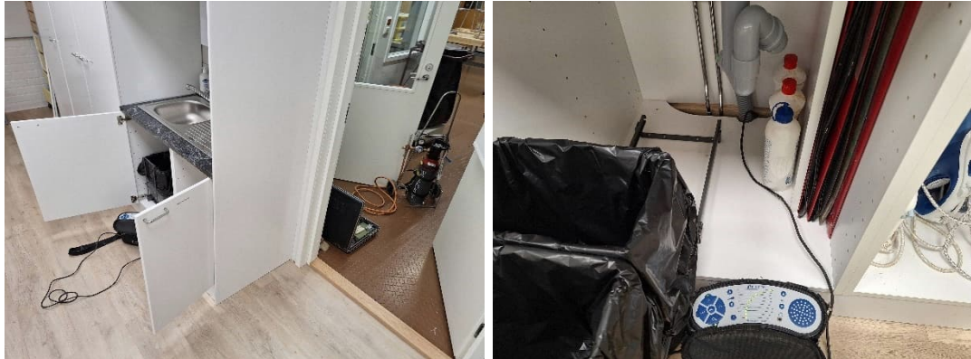
Kuva 30. Alapohjan eristetilaan merkkiainetta laskettiin teknisen työn tilaan 118 tehdyn rakenneavauksen RA19 kautta tilan keskiosassa. Merkkiainevuotoa havaittiin pesualtaan viemäriputken läpiviennistä.
