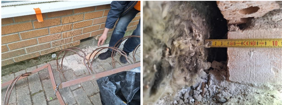
Kuva 56. Julkisivuverhoukseen tehtiin rakenneavaus lisäksi myös ruokasalin 134 ulkoseinään. Ruokasalin kohdalla ulkoseinän tuuletustila on jonkin verran isompi. Rakenneavauskohdalla mineraalivillaeristeen ulkopinnassa on ilmavirtauksen aiheuttamaa tummumaa.
