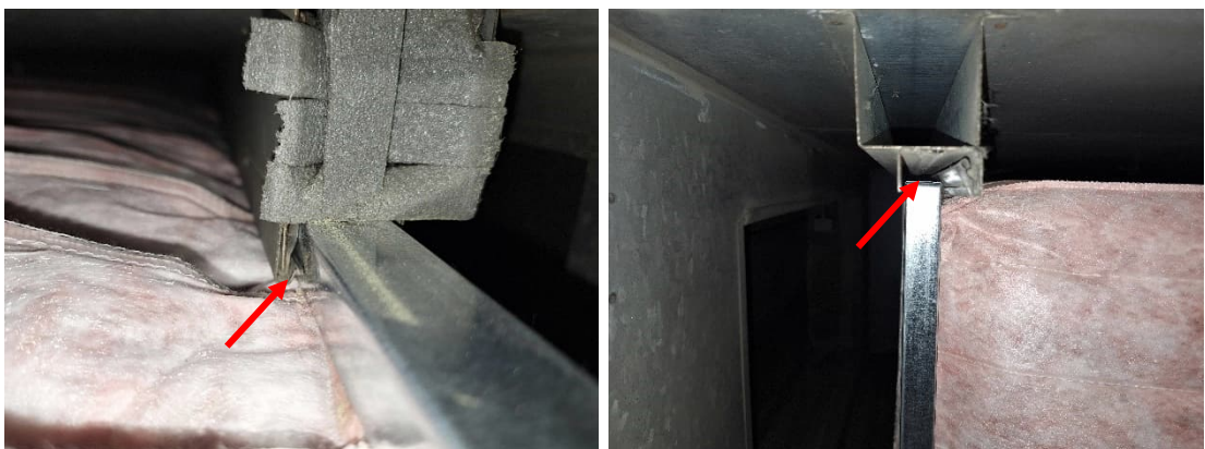
Kuva 102. Yleiskuva ilmanvaihtokoneiden suodatinkehikosta. Suodattimien kehykset eivät tiivisty täysin suodatinosiin.
