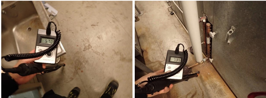
Kuva 32. Välipohjan lattian pintamateriaalina on muovimattopinnoite. Pinnoite on kulunut ja likainen. Välipohjan lattiapinnoilla ei havaittu pintakosteuspoikkeamia.
