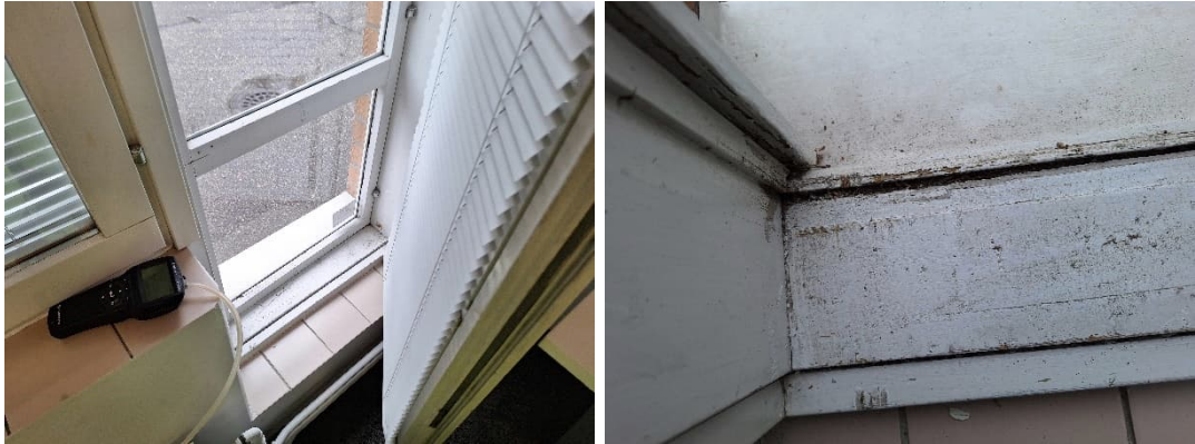
Kuva 45. Sisäpihan puoleisissa ikkunoissa on jonkin verran enemmän pintavaurioita ikkunoiden puuosissa. Ikkunan ulkopuitteiden lisäksi ikkunakarmien sisäpinnan maalipinta hilseilee paikoin.
