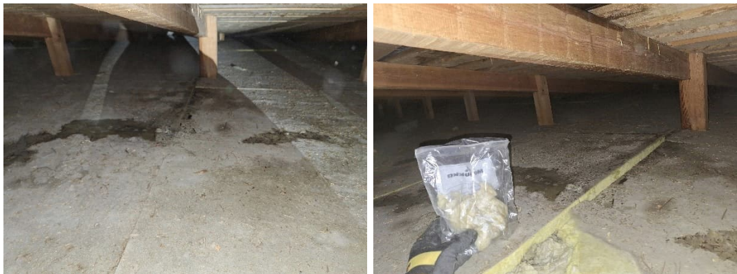
Kuva 96. Materiaalinäyte L14 otettiin havaitusta vesikaton vuotokohdasta rakennuksen eteläpäädyssä. Näyte otettiin lämmöneristekerroksen alapinnasta höyrynsulkumuovin tuntumasta. Näytteessä on analyysivastauksen perusteella mikrobikasvustoa. Vuotokohdalla on vesikattorakenteissa kosteusjälkiä ja voimakas mikrobiperäinen haju.
