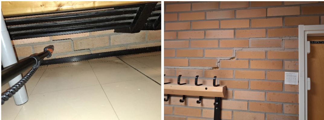
Kuva 68. Käytävän 107 väliseinässä havaittiin yksi halkeama. Väliseinän alaosissa ei havaittu pintakosteuspoikkeamia. Havaintojen perusteella
