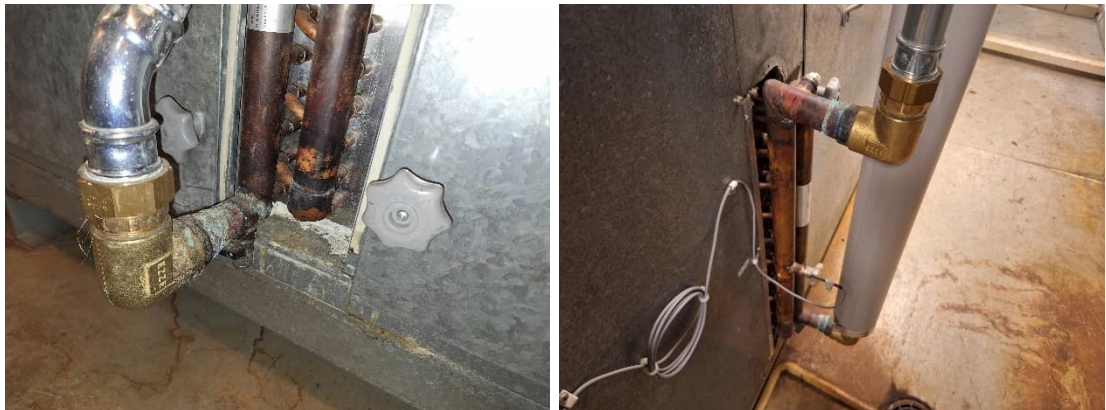
Kuva 104. Yleiskuvat ilmanvaihtokoneiden lämpöpatterien putkistosuuksista. Putkistojen liitoskohdissa on paikoin vuotojälkiä.
