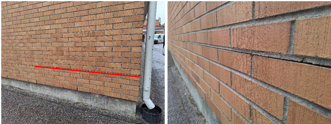
Kuva 39. Rakennuksen julkisivumuurauksessa on vaakahalkeama sisäpihan puolella rakennuksen eteläseinällä, syynä todennäköisesti rakennuksen painuma.
