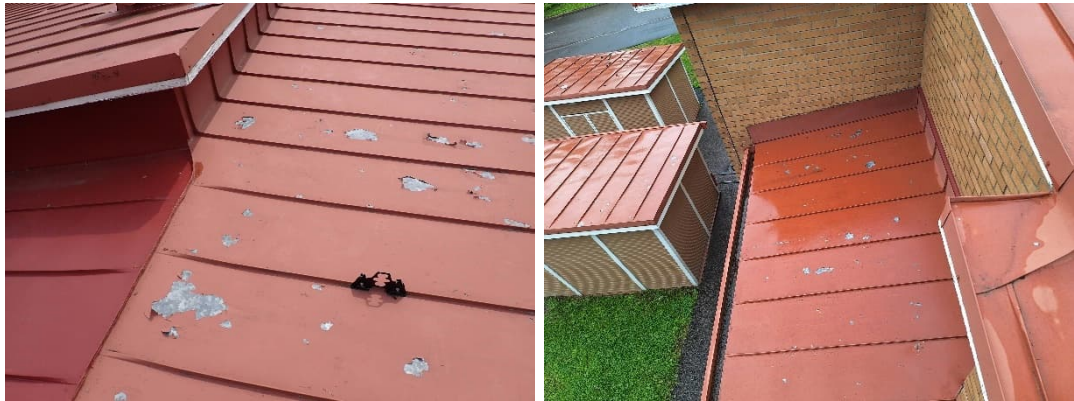
Kuva 77. Koulurakennuksen ja erillisten pienten ulkorakennusten maalipinnoite hilseilee paikoitellen. Sadevesikourut havaittiin puhtaiksi roskasta.
