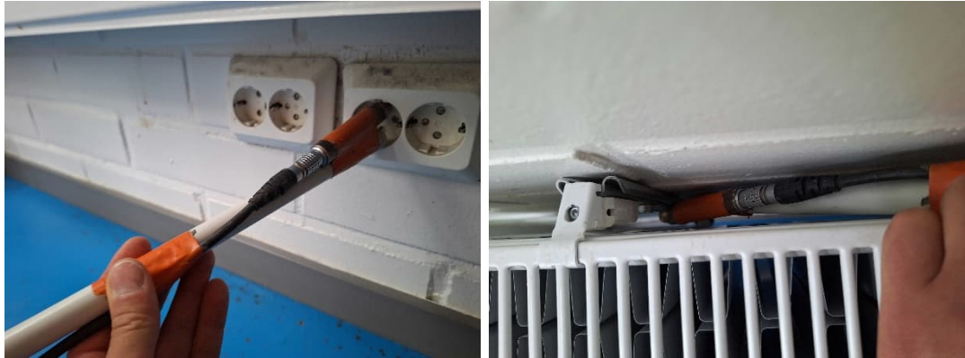
Kuva 64. Ruokalassa 134 tehdyissä merkkiainetutkimuksissa havaittiin merkkiainevuotoa patterin kannakkeiden ja pistorasioiden kohdalta. Betonirakenteisissa sisäkuorissa patterin kannakkeiden kohdalta ei havaittu merkkiainevuotoa.
