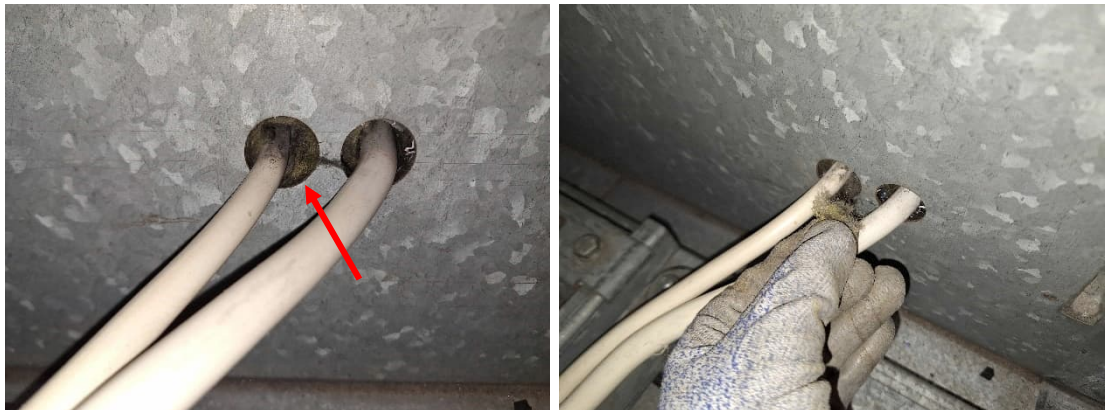
Kuva 109. Yleiskuvat ilmanvaihtokoneiden mittausantureiden läpiviennistä. Läpiviennit ovat avoimia ja koneeseen irtoaa mineraalivillakuituja.
