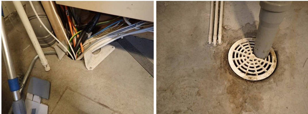
Kuva 34. Johtoläpivienti on kokonaan tiivistämättä, johdot on mahdollisesti johdettu ontelon kautta alempaan kerrokseen.
