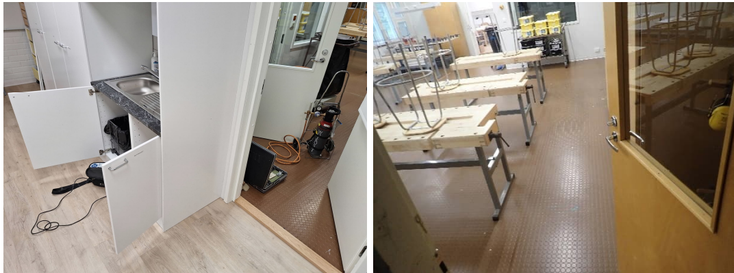
Kuva 14. Ryömintätällisen alapohjan lattian pintamateriaalina on muovimatto tai laminaattilattia. Kuumakäsittelytilan 119 laminaattilattiassa ei havaittu merkittäviä pinnoitevaurioita. Puukäsityöluokan 118 muovimattopinnoitteessa havaittiin kulumaa.
