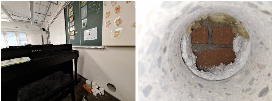
Kuva 57. Ulkoseinärakenteeseen tehtiin tarkentavia rakenneavauksia \varnothing 120 mm sokkelin ja ulkoseinän liittymän tarkemmin arvioimiseksi. Suunnitelmien mukaan sokkelin ja tiiliverhouksen liittymässä tulisi olla bitumihuopakaista. Avausten kautta tehtyjen havaintojen perusteella bitumihuopaa ei havaittu yhdessäkään avauksessa. Kuvassa opetustilan 110 rakenneavaus LRA3. Avauksen mineraalivillaeristeessä on analyysivastauksen mukaan mikrobikasvustoa.
