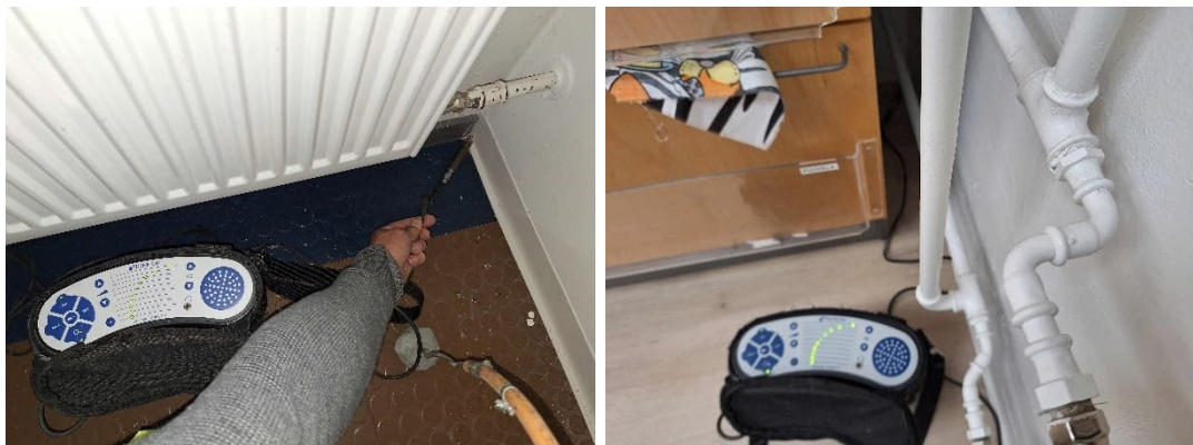
Kuva 31. Teknisen työn tilassa 118 merkkiainetta laskettiin alapohjan eristetilaan myös ulkoseinän läheisyydessä. Merkkiainevuotoa havaittiin ulkoseinän ja alapohjan rakenneliittymästä väliseinän nurkkauksesta väliseinän molemmin puolin.
