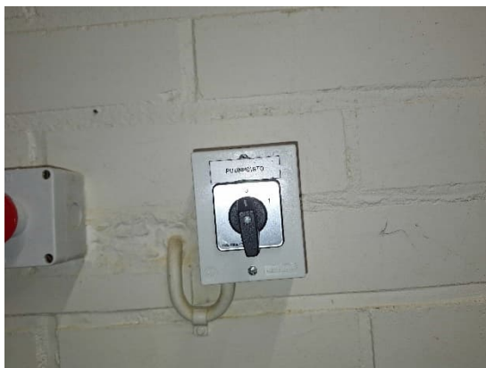
Kuva 112. Yleiskuva teknisten töiden opetustilojen erillispoistopuhaltimen käyntikytkimestä.
