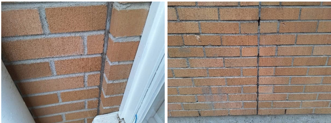
Kuva 40. Julkisivumuurauksen liikuntasaumot ovat ikääntyneet ja kuluneet. Liikuntasauomoissa on tiiveyspuutteita.
