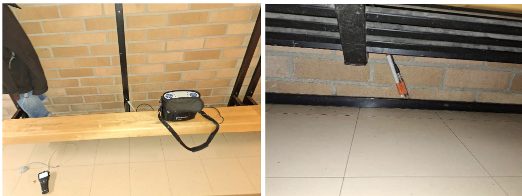
Kuva 25. Alipaineistuksen kanssa tehtyjen merkkiainetutkimusten yhteydessä merkkiainevuotoa havaittiin käytävän 107 väliseinän kohdalta (pistemäinen vuoto). Vuoto havaittiin alipaineistuksen kanssa tehdyissä merkkiainetutkimuksissa. Normaalia käyttöä vastaavissa olosuhteissa havaittiin merkkiainevuotoa pilarin ja alapohjan rakenneliittymästä.
