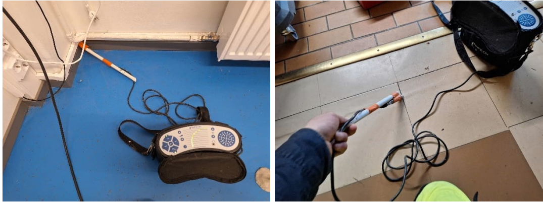
Kuva 22. Merkkiainevuotoa havaittiin pilarien juuresta sekä liikuntasalujen kohdalta. Merkkiainevuodot olivat selkeitä vuotoja.
