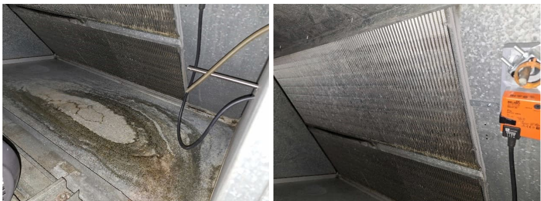
Kuva 105. Yleiskuva TK01 opetustilojen LTO-kuutiosta. Kammion pohjalla kosteusjälkiä ja LTO-osan lamelleissa alkavaa ruostetta.
