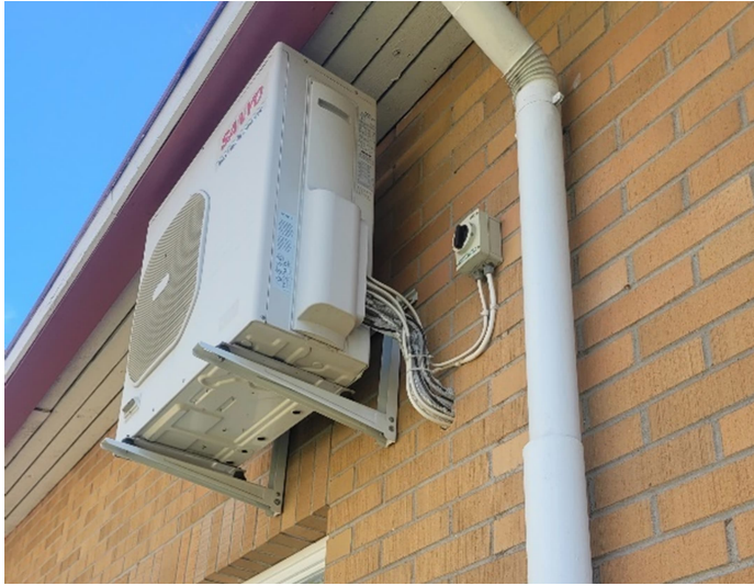
Kuva 38. Ilmalämpöpumpun julkisivun johtoläpivienti on tiivistämättä.
