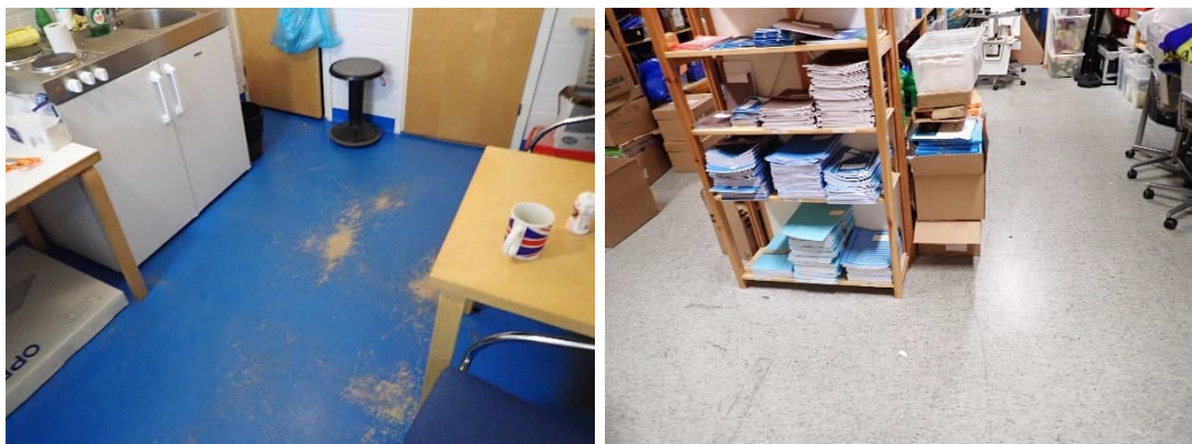
Kuva 15. Sininen pinnoite on kulunut lattiapinnasta tilassa 111. lattiassa on muovimatto.
