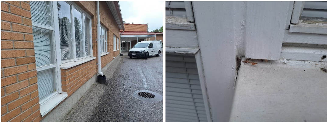
Kuva 46. Ikkunoiden pellitysten kallistukset ovat osittain puutteellisia. Ulkoseinässä erityisesti seinässä alemmalle tasolle sijoittuvien ikkunoiden pellityksissä kaadot olivat paikoin puutteelliset. Ikkunoiden rakenneliittymien massaukset ovat myös epätiivitä.
