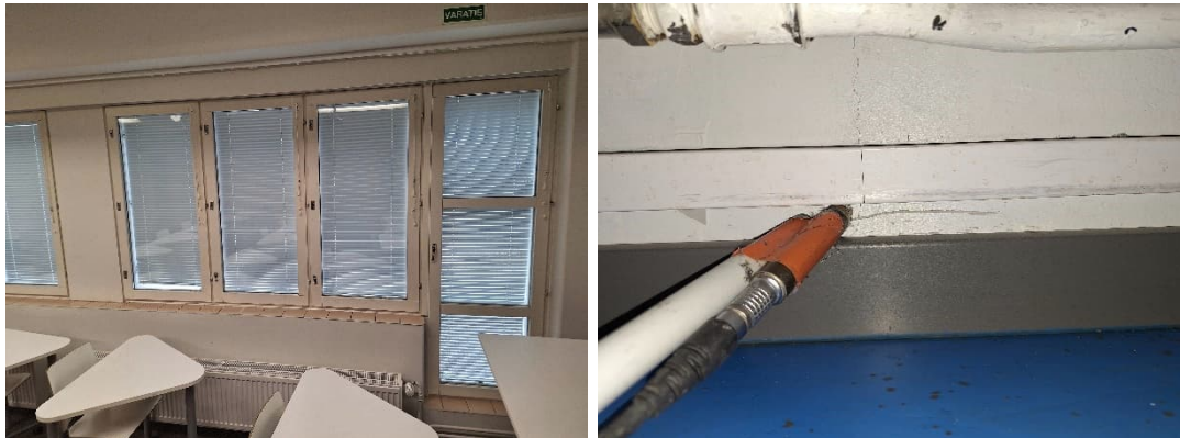
Kuva 50. Ulkoseinien sisäkuori on pääasiassa betonia. Ulkoseinien betoniset sisäpinnat ovat pääasiassa hyvässä kunnossa. Merkkiainetutkimusten yhteydessä havaittiin yksi halkeama ulkoseinän sisäpinnassa.
