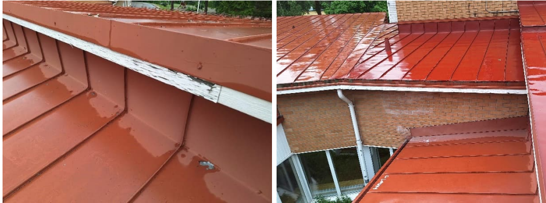
Kuva 41. Räystäslaudat ovat huonossa kunnossa. Maalipinta hilseilee voimakkaasti ja paikoin räystäslaudoissa esiintyy lahoa. Toisessa kuvassa julkisivussa jälkiä poistetuista graffiteista.
