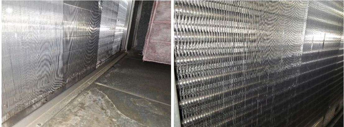
Kuva 103. Yleiskuvia ilmanvaihtokoneiden lämmityspattereista. Pattereissa havaittiin pölykertymää ja kammion pohjalla kosteusjälkiä.
