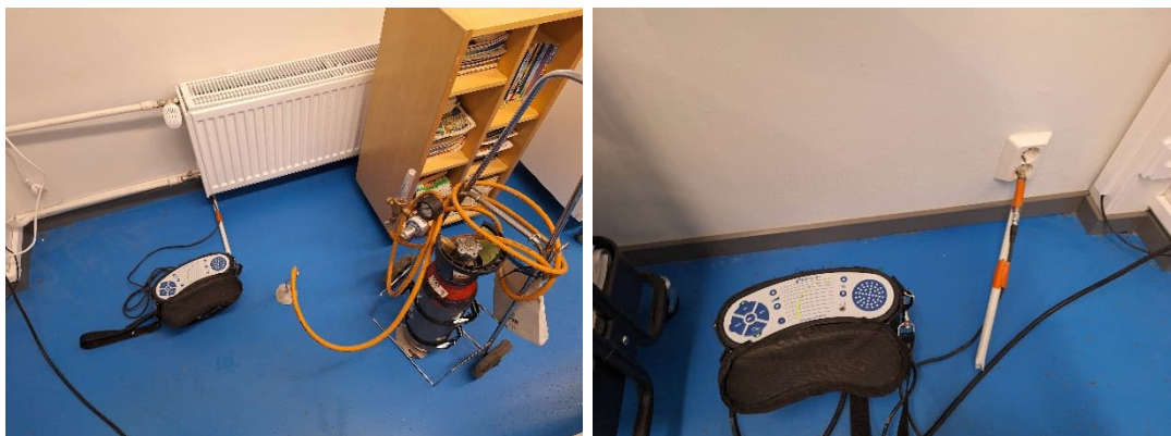
Kuva 23. Tilojen ollessa alipaineistettuna merkkiainevuotoa havaittiin myös ulkoseinän ja alapohjan rakenneliittymästä (pistemäinen vuotokohta) sekä pistorasiasta.
