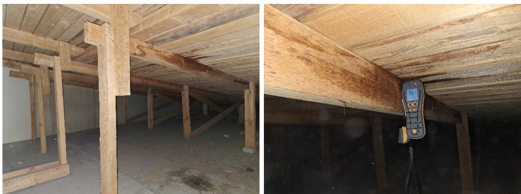
Kuva 80. Yläpohjatilan vesikaton vuotokohta rakennuksen keskiosassa. Puurakenteet ovat vuotokohdalla kastuneet. Puun piikkimittarin näytöllä on lukemana 26 paino-%.
