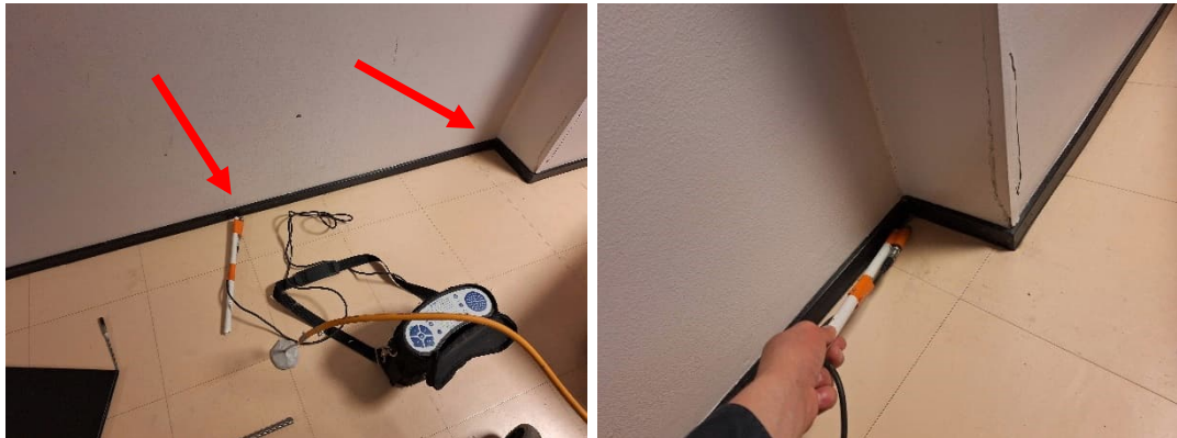
Kuva 24. Käytävän 138 merkkiainetutkimuksissa havaittiin merkkiainevuotoa väliseinän kohdalta (punaiset nuolet). Vuodot olivat voimakkaita vuotoja. Rakennekuvien perusteella väliseinät lähtevät vahvennetun betonilaatan päältä. On mahdollista, että vuotokohdilla on halkeamia betonilaatassa.
