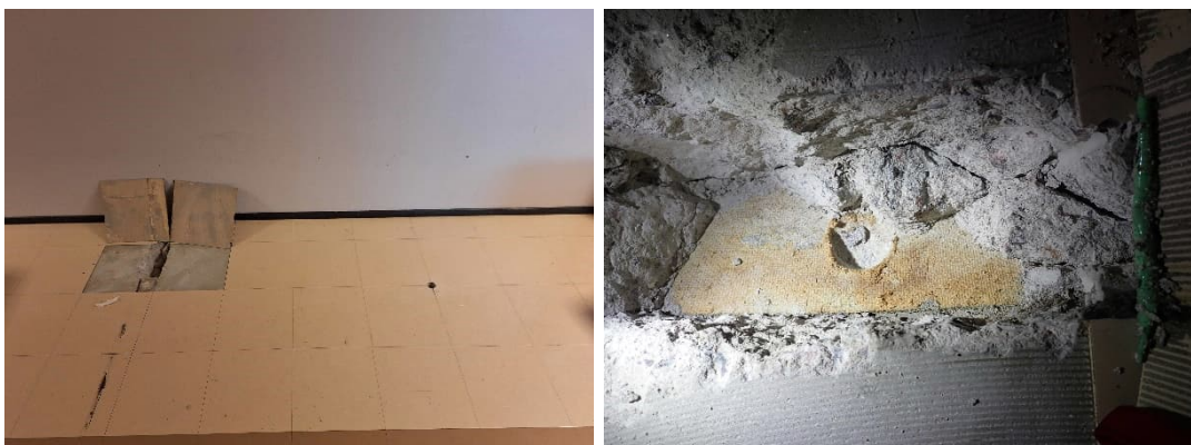
Kuva 10. Käytävällä liikuntasauvan kohdalla on alapohjalaatassa liikuntasauvan myötäisiä halkeamia. Laattojen välinen liikuntasauva on toteutettu käyttämällä betonilaattojen välissä kovalevyä. Valun yhteydessä
