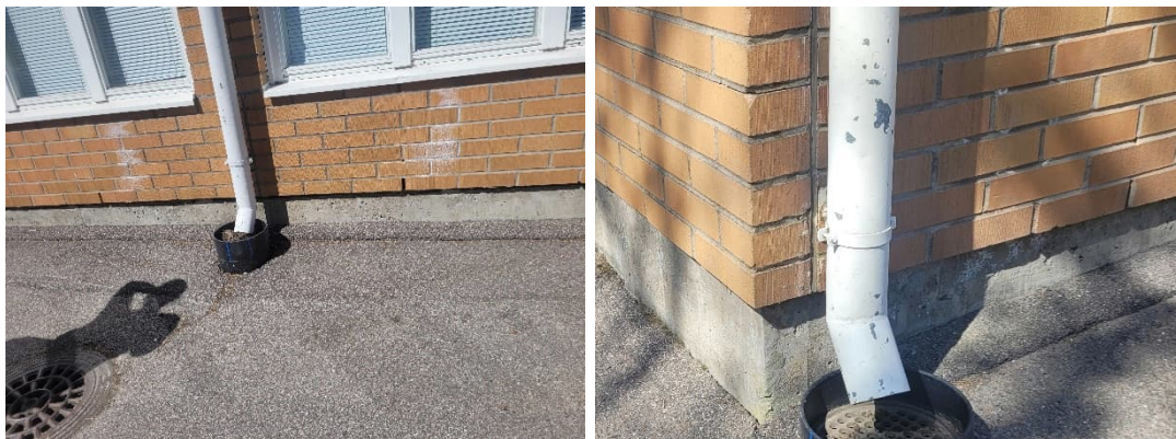
Kuva 37. Kuvassa sisäpihan puoleisen ulkoseinän tiiliverhouksen pinnassa havaittiin kalkkihärmettä kahdessa kohtaa. Kalkkihärme tiilen pinnassa viittaa kastuneen seinärakenteen kuivumiseen. Kalkkihärmehavainnot tehtiin kattovesien syöksyjen läheisyydessä.
