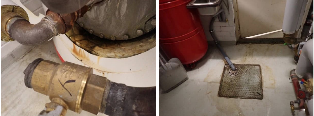
Kuva 17. Putkiliitos vuotaa talon varastotilan 136 lattialle. Vesi valuu kynnyksen ali viereiseen kattilahuoneeseen 135.
