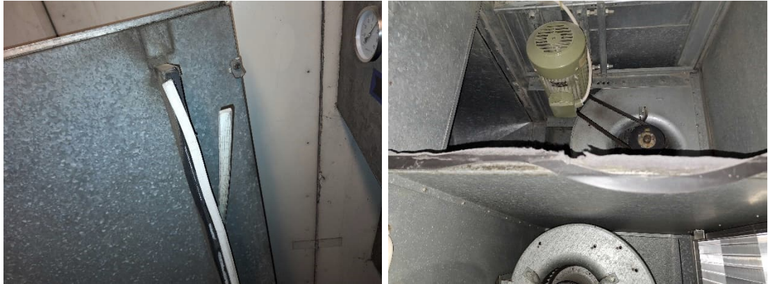
Kuva 108. Yleiskuvia ilmanvaihtokoneiden huoltoluukkujen tiivistyksistä. Tiivistet ovat haurastuneet ja paikoin rikki.
