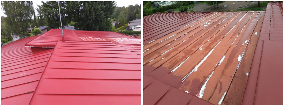
Kuva 78. Pohjoispäädyssä kattolappeiden vesikate on vasta pinnoitettu. Pieneltä osalta vesikate on jäänyt pinnoittamatta.
