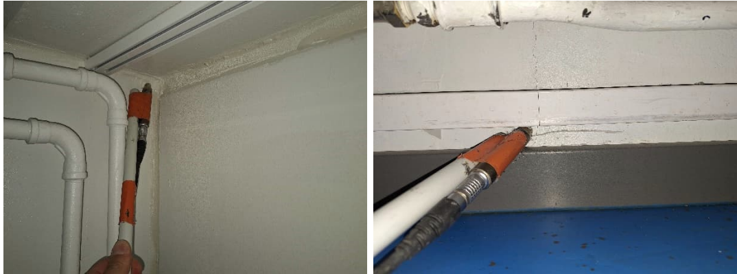
Kuva 66. Alipaineistajan kanssa tehtyjen merkkiainetutkimusten yhteydessä havaittiin merkkiainevuotoa seinän sisäpinnan halkeamasta (tila 174) sekä elementtisaumoista (tila 167).
