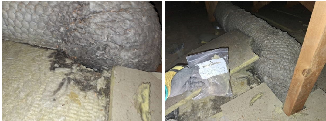
Kuva 95. Materiaalinäyte L13 otettiin yläpohjan IV-läpiviennin juuresta rakennuksen eteläpäädyssä. Materiaalinäytteessä ei ole mikrobikasvustoa. Läpiviennin ympärillä on ilmavirtausten aiheuttamaa tummentumaa.
