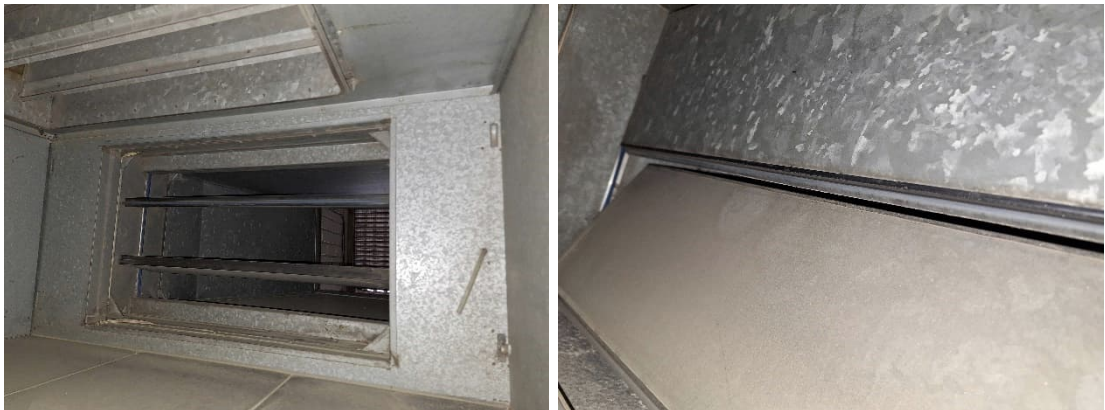
Kuva 101. Yleiskuvat ilmanvaihtokoneiden raitisilmapelleistä. Pellit eivät sulkeudu koneen ollessa seis -tilassa. Havainto koneissa TK02 ja TK03.
