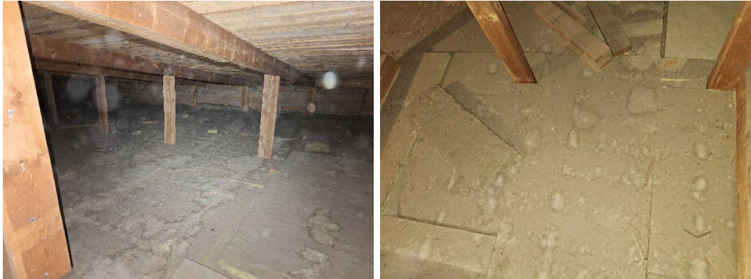
Kuva 81. Yläpohjan mineraalivillalevyjen päällä on todennäköisesti kondenssiveden aiheuttamia vesijälkiä. Vesijälkiä on tasaisesti yläpohjatilassa. Puurakenteet ovat kuivat, eikä niissä ole pääosin havaittavissa viitteitä vaurioista.
