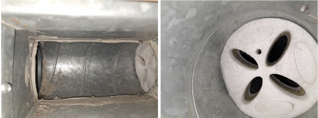
Kuva 116. Tuloilmakanavistoon on asennettu äänen- ja säädönvaimentimia.
