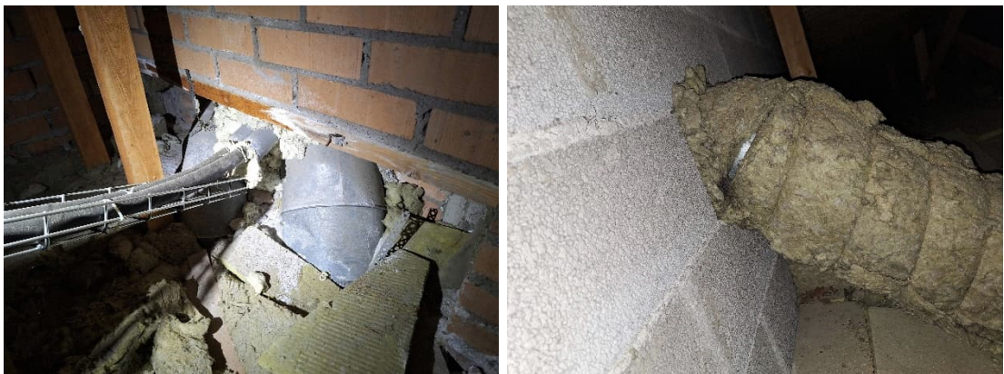
Kuva 118. Yläpohjassa havaittiin ilmanvaihtokanavistossa eristyspuutteita.
