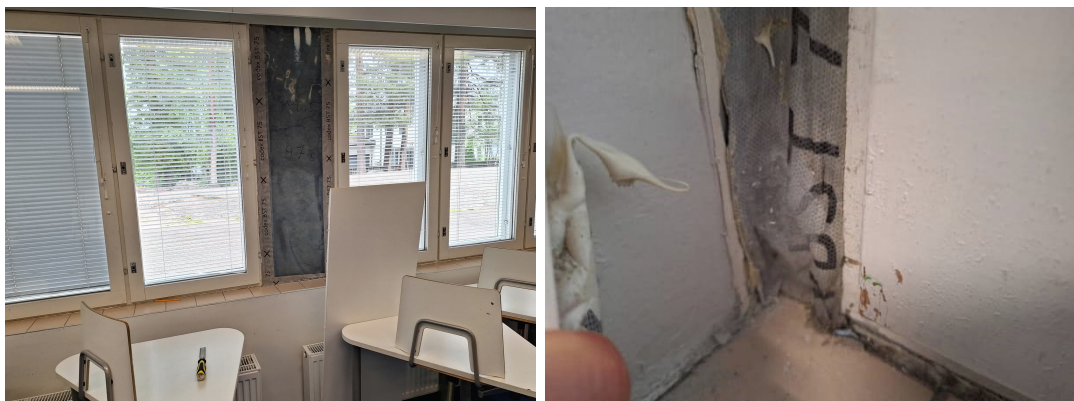
Kuva 51. Ikkunoiden väleissä ulkoseinän sisäpinta on levyrakenteinen. Seinän sisäpinnan höyrynsulkumuovi on tiivistetty tiivistysnauhalla liittyviin rakenteisiin. Tiivistysnauha on paikoitellen huonosti kiinni ympäröivissä rakenteissa.
