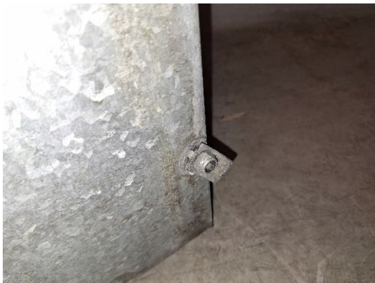
Kuva 107. Yleiskuva ilmanvaihtokoneiden huoltoluukkujen lukitusmekanismista. Luukkujen lukitukset ovat paikoin rikki.
