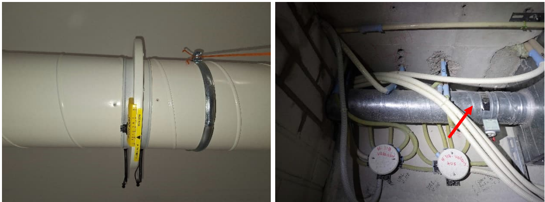
Kuva 117. Ilmanvaihtokanavistossa on ilmamääräsäätimiä eri vuosilta.
