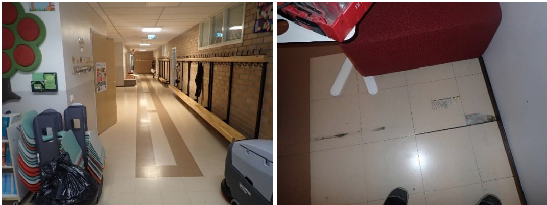
Kuva 9. Käytävän vinyylilaattapinnoissa on jonkin verran kulutusjälkiä. Käytävällä liikuntasauvojen kohdalla on vinyylilaatoissa halkeamia.
