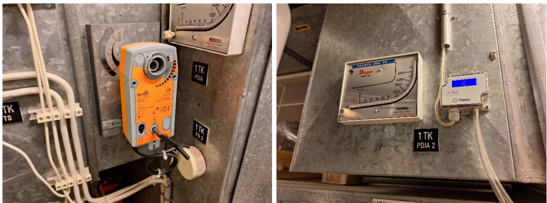
Kuva 110. Yleiskuvat ilmanvaihtokoneiden toimilaitteista. Osa toimilaitteista on uusittu 2020-luvulla.
