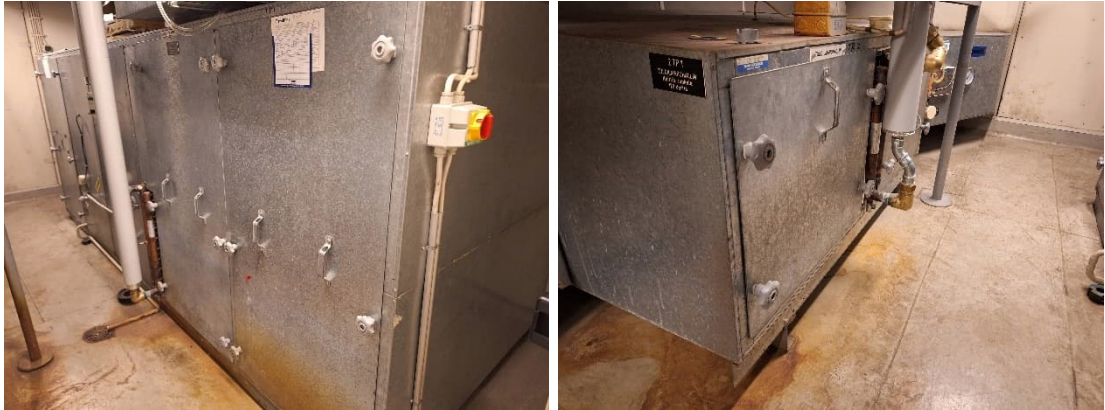
Kuva 100. Yleiskuvat ilmanvaihtokoneista (TK01 ja TK02). Ilmanvaihtokoneen rungoissa havaittiin ohivuotoja.
