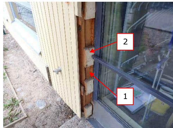
Yleiskuva rakenneavauksesta. Rakenneavauksen perusteella teräsövet on asennettu arkkitehtipiirustuksessa esitettyä syvemmmälle. Pielen kohdalla oleviin runkotolppiin [1] oli lisäksi kiinnitetty puuklossit [2], jotka toimivat pieleen asennetun vanerilevyn asennusalustana.
