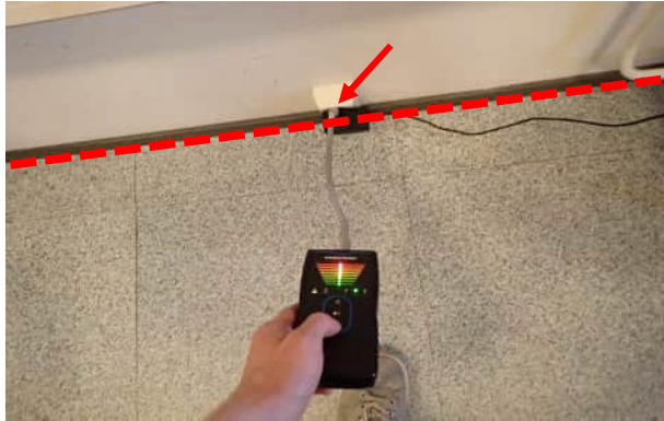
1. Pohjoisenpuoleisella julkisivulla sähkörasiasta havaittiin merkittävää pistemäistä ilmavuotoa sekä merkittävää laaja-alaista vuotoa välipohjaliittymästä
