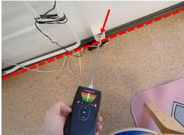
1. Sähkörsiasta havaittiin merkittävää ilmavuotoa lännenpuoleisella julkisivulla.
