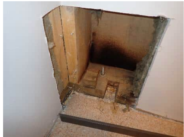
Havainnekuva rakenneavauksesta. Tuulensuojalevyn sisäpinta oli silmämääräisen tarkastelun perusteella hiiltynyt. Myös runkotolpan alareunassa oli havaittavissa vastaavia värimuutoksia.
