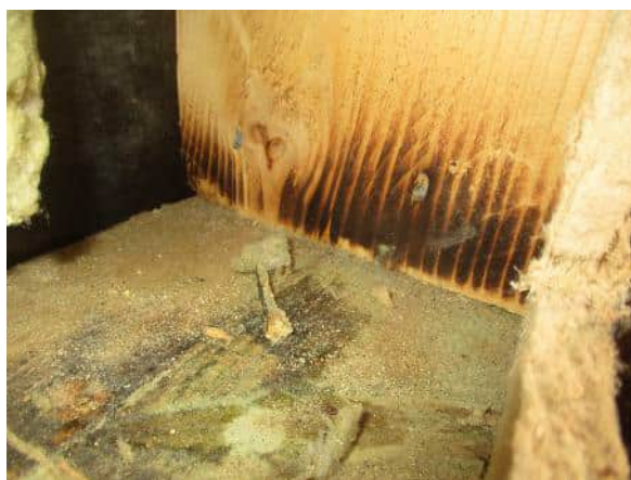
Alaohjauspuun pinnalla ja pystyrungon alaosassa todettiin tummentumaa/hiiltymää, jota todettiin myös muissa rakenneavauksissa.
