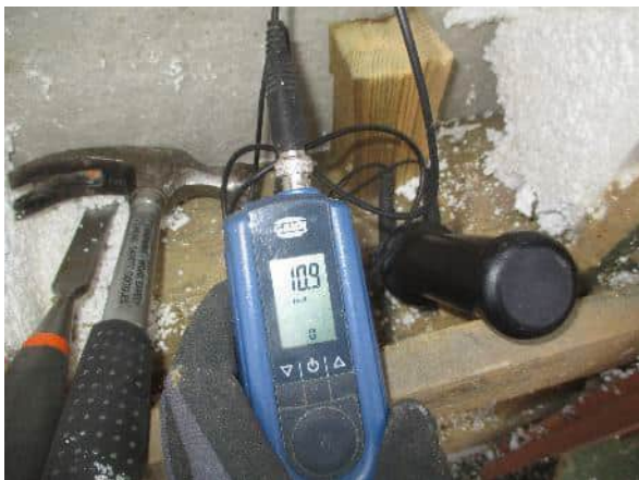
Alahjauspuun alapinnan kosteus oli tavanomaisella tasolla 10,9 p-%, eikä se ylittänyt puurakenteiden vaurioitumiselle kriittistä kosteutta. Rakenneavauksen kohdalla [REDACTED] ei todettu kohonneita pintamittausarvoja (Gann lukema 49-51, mittarin vaihteluväli 0-100).
