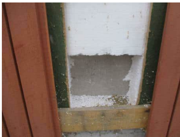
Havainnekuva rakenneavauksesta. Suunnitelmista poiketen rakenteen lämmöneristeenä oli EPS-levy (suunnitelmissa PU-levy). Rakenneavauskohdassa ei aistinvaraisesti todettu viitteitä vaurioista.
