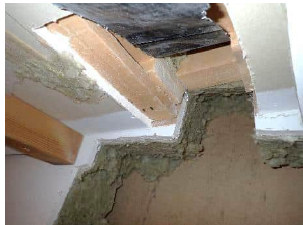
Havainnekuva rakenneavauksesta. Ulkoseinän tuulensuojalevynä käytetyn huokoisin puukuitulevyn sisäpinnassa oli havaittavissa tummia jälkiä, joiden koostumus ja alkuperä jäi epäselväksi.
