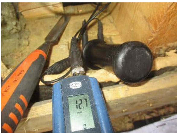
Alaohjauspuun alapinnan kosteus oli tavanomaisella tasolla 12,7 p-%, eikä se ylittänyt puurakenteiden vaurioitumiselle kriittistä kosteutta. Pystyrungon alaosan kosteus oli 13,6 p-%.
