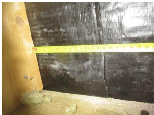
Rakenneavauksen kohdalla todettiin ulkoseinän höyrynsulun limitys. Limitys oli aistinvaraisesti tiivis ja limityskohta on runkotolpan kohdalla.
