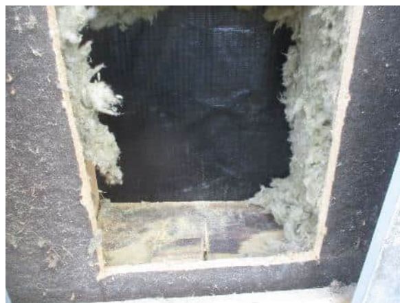
Havainnekuva rakenneavauksesta. Alaojhauspuun pinnalla on tummentumaa/hiiltymää, jota todettiin myös muissa rakenneavauksissa. Rakenneavauskohdassa ei aistinvaraisesti todettu viitteitä seinärakenteen alaosan vaurioitumisesta.
