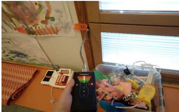
4. Vähäistä pistemäistä ilmavuotoa idänpuoleisella julkisivulla ikkunan karmiliitoksesta.
