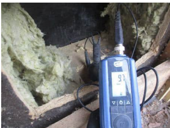
Alaohjauspuun alapinnan kosteus oli tavanomaisella tasolla 9,7 p-%, eikä se ylittänyt puurakenteiden vaurioitumiselle kriittistä kosteutta. Pystyrungon alaosan kosteus oli 9,8 p-%.
