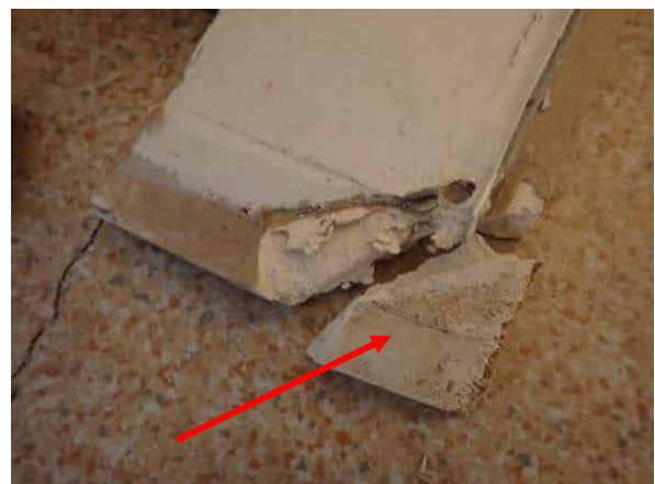
Kipsilevyn alareunassa (sisäpinta) havaittiin kosteusrasitukseen viittaavaa värjäytymää (punainen nuoli). Lisäksi levyn pinnassa olevan kartongin liimaus oli heikentynyt. Kartongin materiaalinäytteessä MA.06-US havaittiin bakteerikasvua.
