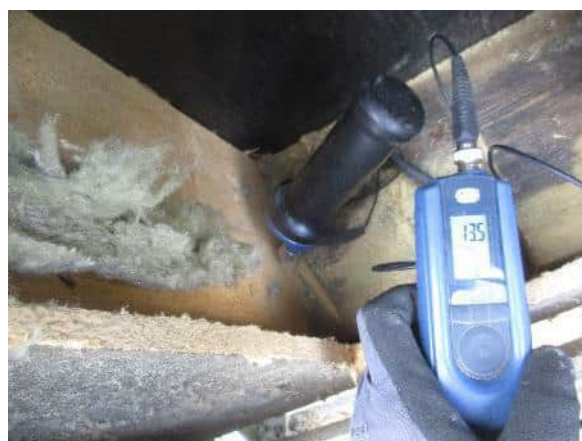
Runkotolpan alaosan kosteus oli tavanomaisella tasolla 13,5 p-%, eikä se ylittänyt puurakenteiden vaurioitumiselle kriittistä kosteutta.
