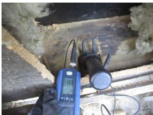
Alaojhauspuun alapinnan kosteus oli tavanomaisella tasolla 13,7 p-%, eikä se ylittänyt puurakenteiden vaurioitumiselle kriittistä kosteutta.
