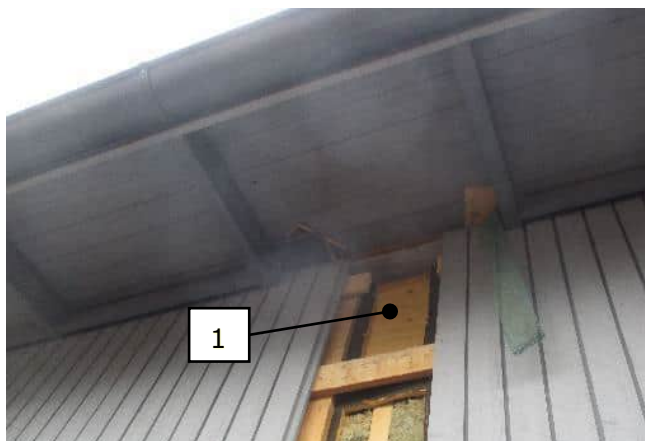
Yleiskuva rakenneavauksesta. Rakenneavauksen kohdalla on ulkoseinän yläpuolella salin kohdalla olevan yläpohjarakenteen (YP2) poikittaispalkki.
