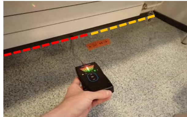
5. Kokonaisuutena tarkasteltuna merkittävää laaja-alaista ilmavuotoa havaittiin itäjulkisivulla välipohjaliittymästä.
