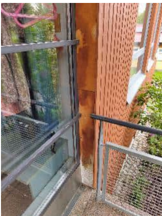
Yleiskuva rakenneavauskohdasta. Rakenneavaus tehtiin kohtaan, jossa ovipielen ulkoverhouksena käytetyssä vanerilevyssä oli havaittavissa kosteusra-situkseen viittaavaa värimuutoksia.
