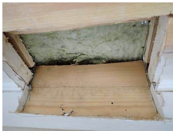
Havainnekuva rakenneavauksesta. Rakenneavauksen kohdalla höyrynsulkumuovi on ulotettu yhtenäisenä yläpohjan ja ulkoseinän liittymän yli.
