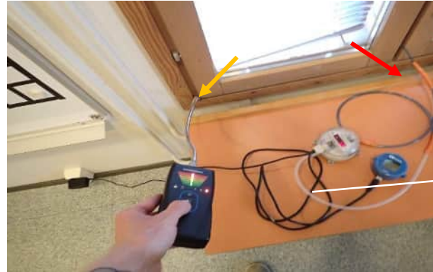
2. Pohjoisenpuoleisella ulkoseinälinjalla vähäistä pistemäistä ilmavuotoa karmiliittymästä ja merkittävää pistemäistä vuotoa lämmityspatterin kannakkeen kohdalta.
