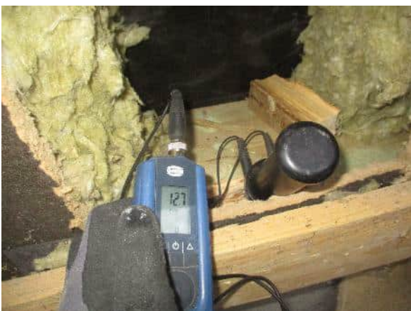
Alaohjauspuun alapinnan kosteus oli tavanomaisella tasolla 12,7 p-%, eikä se ylittänyt puurakenteiden vaurioitumiselle kriittistä kosteutta.
