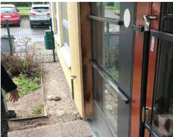
Yleiskuva rakenneavauskohdasta. Rakenneavaus tehtiin kohtaan, jossa ovipielen ulkoverhouksena käytetyssä vanerilevyssä oli havaittavissa kosteusra-situkseen viittaavaa värimuutoksia.
