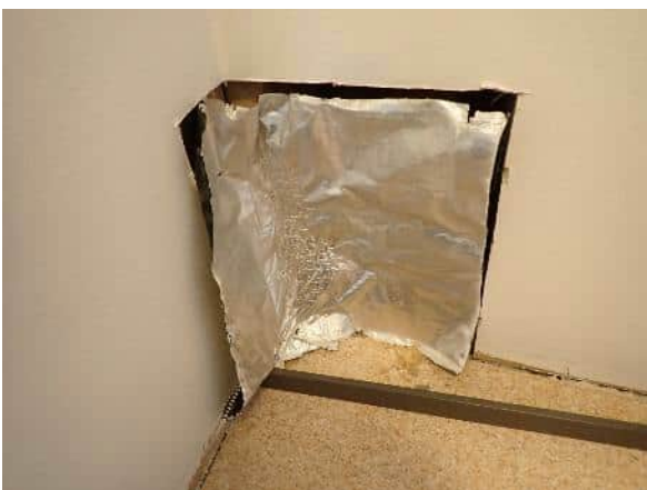
Ulkoseinän höyrynsulkuna on käytetty alumiinikalvon sisältävää höyrynsulkukalvoa (monikerroslaminaatti). Höyrynsulkua ei ole liitetty millään tavoin alapohjaan. Liittymässä ei myöskään havaittu detaljissa (jäjempänä) esitettyä elastista massa tai pohjanauhaa.
