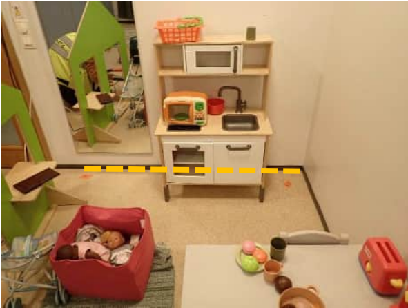
1. Välipohjan ja kantavan väliseinän (VS1) liittymästä todettiin heikkoa laaja-alaista ilmavuotoa. Ilmavuotoa havaittiin sekä ilmanvaihdon tarkasteluhetken mukaisissa normaaleissa käyttöolosuhteissa ja alipaineistettuna. Alipaineistus ei vaikuttanut vuotojen laajuuteen.
