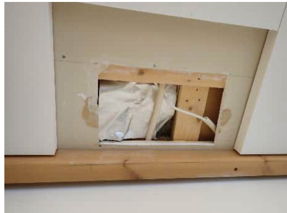
Havainnekuva rakenneavauksesta. Sähköputket on asennettu yläpohjan huokoisen puukuitulevyn ja kipsilevyn välissä olevan koolaukseen muodostamaan ontelotilaan.
