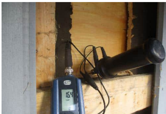
Ulkoseinän rungon yläosassa olevan yläpohjapalkin kosteus oli tavanomaisella tasolla 16,4 p-%, eikä se ylittänyt puurakenteiden vaurioitumiselle kriittistä kosteutta.
