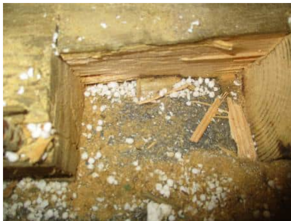
Rakenneavauksen alahjauspuun alapuolella on solumuovi. Leikkauksessa (RAK_LEIKKAUS JA DETALJI [REDACTED] leikkaukset 1-2.pdf) alahjauspuun alapuolella on esitetty kumibitumikermi.
