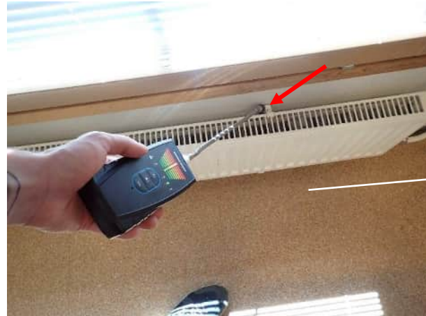
2. Lämmityspatterin kiinnikkeestä havaittiin merkittävää ilmavuotoa lännenpuoleisella julkisivulla.
