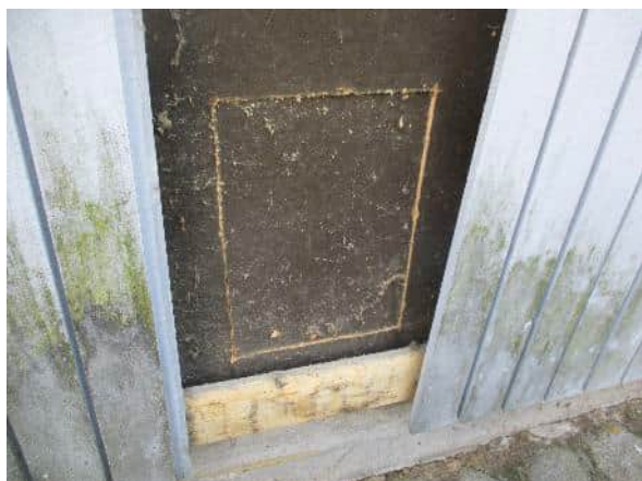
Yleiskuva rakenneavauksesta. Rakenneavauskohdassa on julkisivulaudoituksen ulkopinnassa levä-/sammalkasvustoa.
