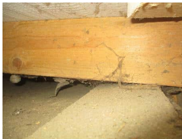
Rakenneavauksen kohdalta yleiskuva yläpohjan eristeen ja aluskatteen väliin. Kohdalla ei todettu vuoto- tai kosteusjälkiä. Kohdassa todettiin roskaa.
