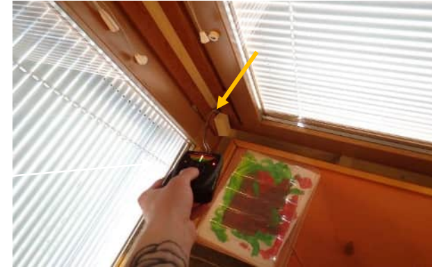
3. Vähäistä pistemäistä ilmavuotoa huoneen kulmassa ikkunoiden karmiliitoksesta.
