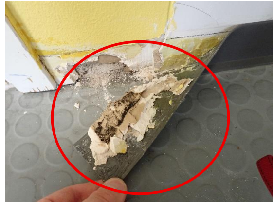
Kuva 12 Käytävän 201 käsien kuivauspisteen alapuolella kipsilevy aistinvaraisesti vaurioitunut.
