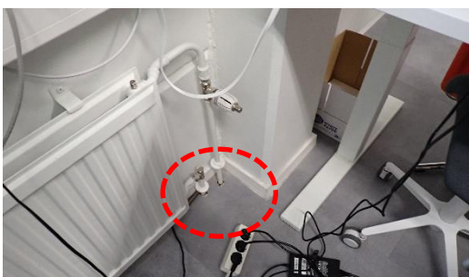
Vuotoa havaittiin myös tilan 224 puolella putkiläpiviennissä
