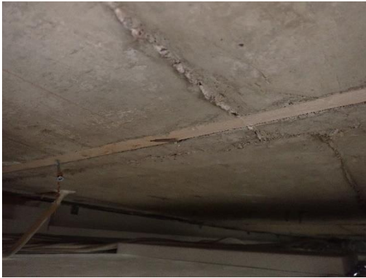
Kuva 22 Välipohjan alapinnassa betonivaluun upotettu puurima.
