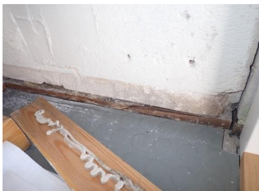
Kuva 10 Sähkökaapissa tilan 226 vieressä jal- kalistan taustalla on näkyvissä sipo- rex-elementin alla puinen korotus- rima.
