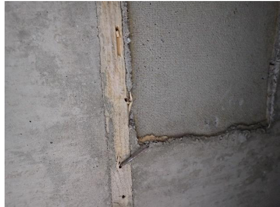
Kuva 23 Välipohjan alapinnassa betonivaluun upotettu puurima.
