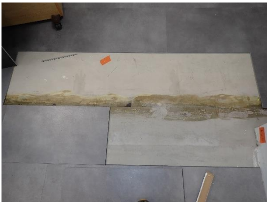
Kuva 26 Tilassa 161 on lattiapinnoitteen liimauksessa käytetty voimakkaasti kemialliselta haisevaa liimaa.
