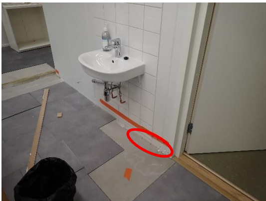
Kuva 15 Tilan 161 vesipisteen vireissä väliseinässä havaittiin poikkeavaa kosteutta ja mikrobiperäistä hajua 19.9.2025
