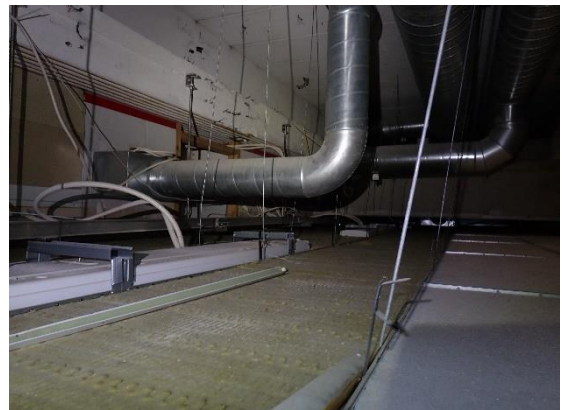
Kuva 25 Käytävällä 242 alakaton akustolevyt reunoista ja päältä pinnoittamattomia
