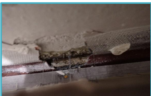
Tiivistys rikkoutunut jalkalistan takaa
