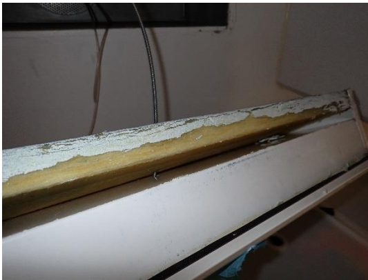
Kuva 36 Tilan 258 tuloilmapäätelaitteessa on mineraalivillaa.
