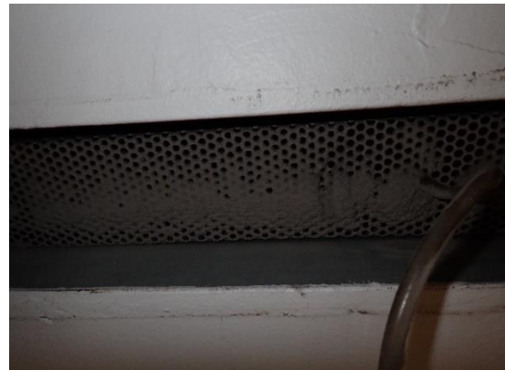
Kuva 37 Tilan 258 poistoilmasäleikössä on runsaasti pölyä.
