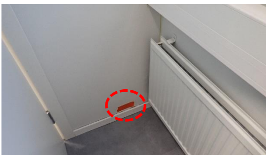
Vuotoa havaittiin myös tilan 224 puolella väliseinäliittymässä
