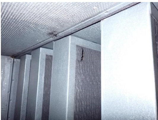
Kuva 38 Ilmanvaihtokoneiden lamelliäänenvaimentimissa on pinnoitteessa rikkoutumia.
