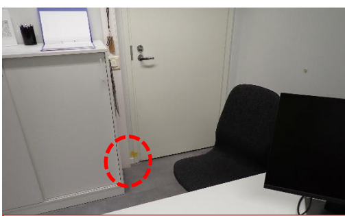
Vuotoa havaittiin myös tilan 223 puolella väliseinän oviliittymässä
