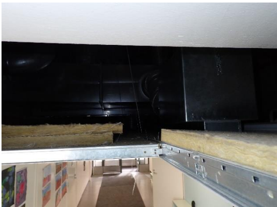
Kuva 24 Käytävällä 242 alakaton akustolevyt reunoista ja päältä pinnoittamattomia.
