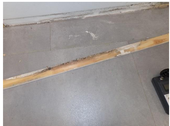
Kuva 14 Luokan 244 käsien kuivauspisteen alapuolella puinen jalkalista ja seinän alaosan tasoite aistinvaraisesti vaurioitunut. Jalkalistan takana pintakosteus kohonnut.
