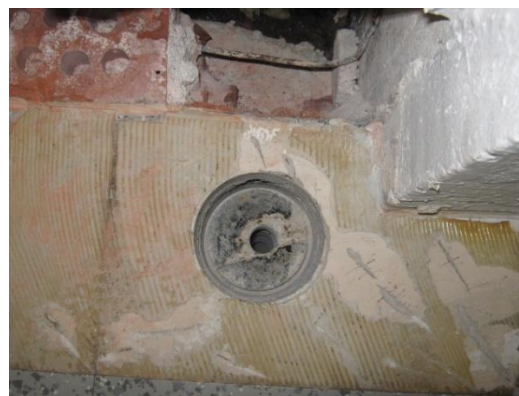
Kuva 22. Käytävällä 1-57 oleva rakenneavaus RA-AP6 (luokan 1-54 kohdalla). Rakenteessa ei ole lämmöneristystä. Alimman laatan yläpinnassa on vedeneristys.
