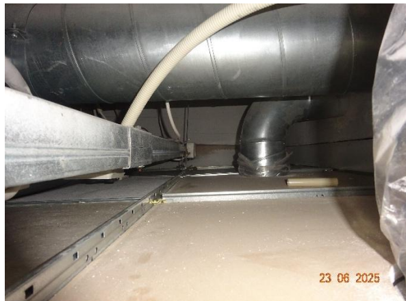
Kuva 111. Luokan 2-32 alakaton päällä on pölyä.
