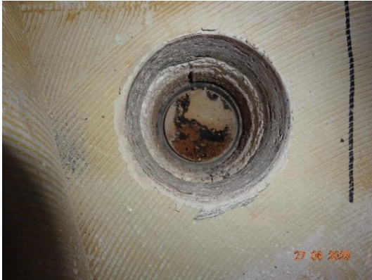
Kuva 17. Alapohjan rakenneavaus luokassa K-07, RA-AP1. Avauksen pohjassa näkyvissä alalaatan pinnassa oleva vedeneristys.
