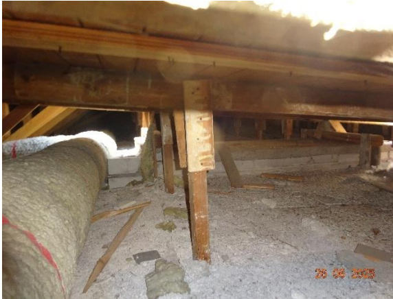
Kuva 130. Eristettyä IV-kanavaa sekä betoni- ja tiilirakenteista IV-kanaalia.
