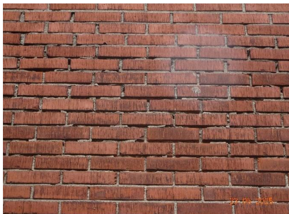
Kuva 42. Erikoisluokkasiiven lounaispäädyssä on muurauksen saumoissa rapautumaa.
