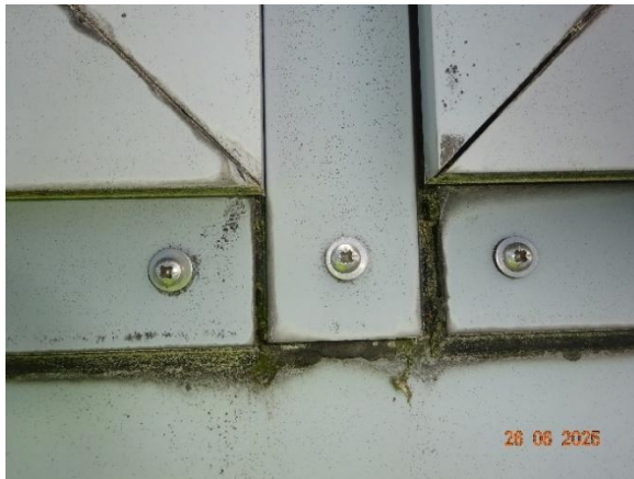
Kuva 122. Luokkasiiven ja hallinto-osan portaikon kattoikkunan kittauksien ja ikkunan rakenteiden liitoksissa on sammal-kasvustoa.
