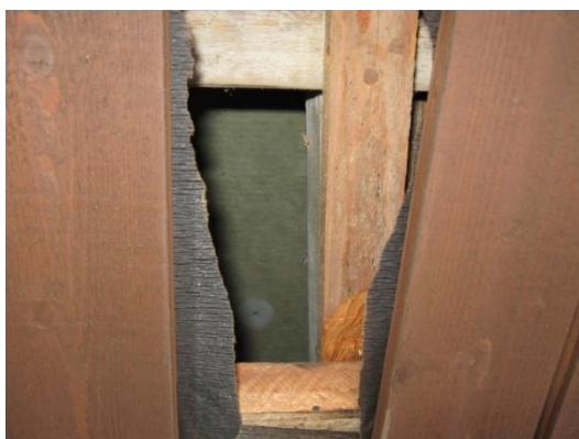
Kuva 1. Ulokkeen alapinnasta irrotetun laudan kohdalta näkyy rakenne.
