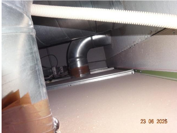
Kuva 112. Luokan 2-27 alakaton päällä on pölyä ja rakennusmateriaalien muruja.
