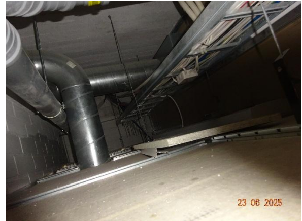
Kuva 105. Kuvassa näkymä luokan 1–60 alakaton päältä. Alakattolevyjen päällä on pölyä ja roskaa. Välipohjan betonirakenteen alapintaa ei ole pölynsidontamaalilla käsitelty.
