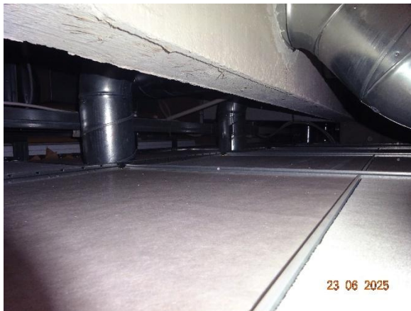
Kuva 110. Näkymä luokan 2-35 alakaton päältä. Oikeassa yläkulmassa olevan IV-kanavan pinnassa on pölyä.
