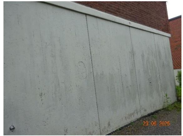
Kuva 44. Luokkaosan luoteispääty. Sokkelin alalaidassa on näkyvissä patolevyä. Sokkelin alalaidassa esiintyy maalin hilseilyä.
