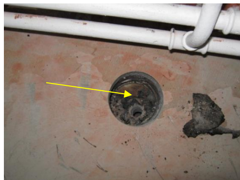
Kuva 2. Rakenneavauksessa näkyy korkki-kerros sekä rakenneavauksen pohjalla alimman betonikerroksen päällä olevaa lautakerrosta (keltainen nuoli).
