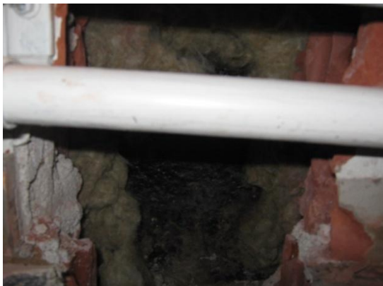
Kuva 2. Kuva rakenneavaus aukon pohjalta, jossa näkyy sokkelin sisäpinnassa oleva pikisively.
