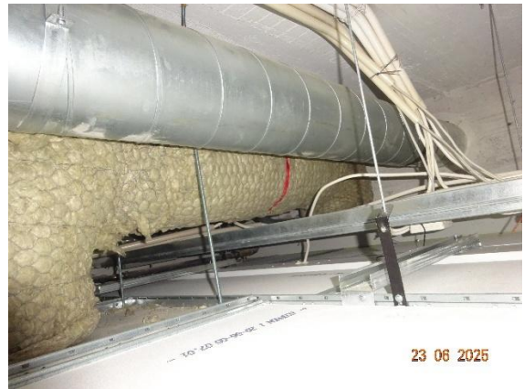
Kuva 109. Kotitalousluokan 1-66 alakaton päällä on IV-kanavia sekä eristettyjä IV-kanavia. Kuvassa olevaa IV-kanavan eristystä ei ole pinnoitettu.
