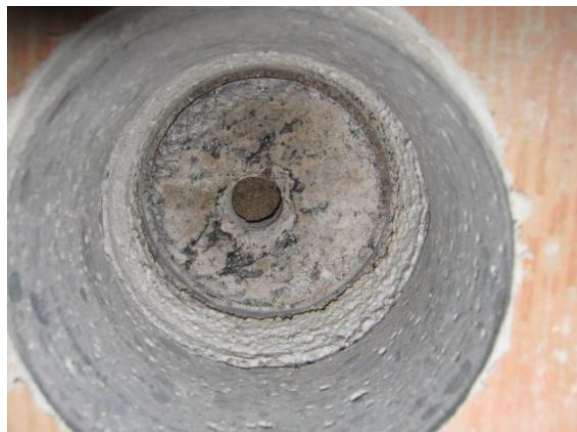
Kuva 2. Näkymä rakenneavauksesta. Alimman laatan alla oleva täyttökerros on painunut.
