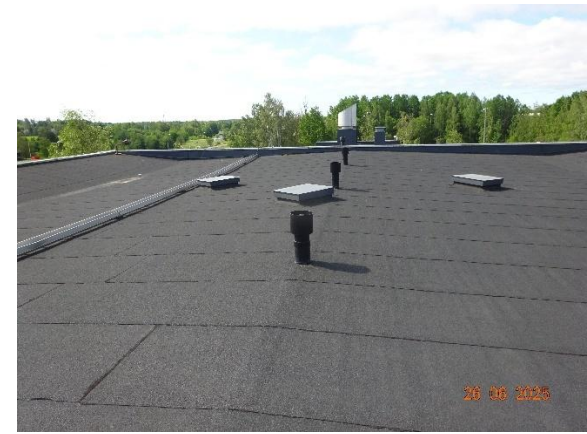
Kuva 115. Liikuntasalin katon alipainetuulettimia sekä kattoluukkuja.
