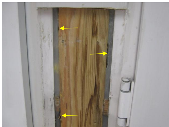
Kuva 2. Ikkunoiden välissä oleva rakenne (US 13). Harmaa elastinen massa on paikoin vetäytynyt (keltainen nuoli).
