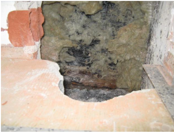
Kuva 59. Rakenneavaus käytävällä 1–57 RA-US8 luokan 1–61 kohdalla. Sokkelin sisäpinnassa on pikisively.
