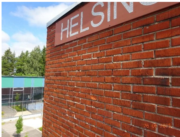
Kuva 47. Liikuntasalin julkisivussa esiintyy rapautumista lounaispäädystä.
