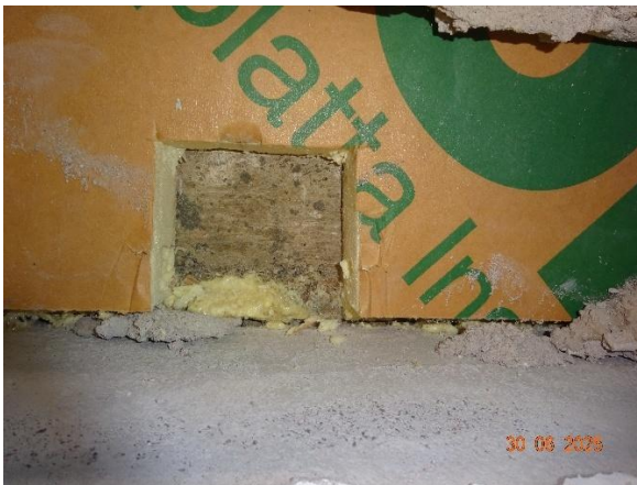
Kuva 55. Teknisenluokan ulkoseinän rakenneavaus RA-US4. Seinässä oli 30 mm PU-eriste, sokkelin sisäpinnassa ei ollut vedeneristystä.
