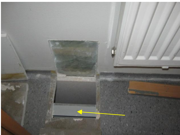
Kuva 1. Rakenneavaus tehtiin välipohjaan ulkoseinän viereen, kuvassa myös U-teräs, joka on välipohjan kannatin (keltainen nuoli).
