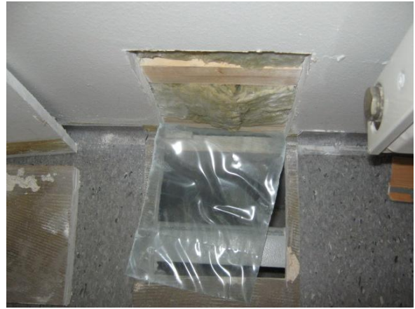
Kuva 64. Kanslian 2-05 ulkoseinän rakenneavaus RA-US14. Rakenne on puurunkoinen, eikä siinä havaittu normaalia poikkeavaa aistinvaraisesti havainnoituna.
