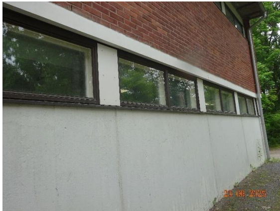
Kuva 69. Opetusosalla olevia 1. kerroksen käytävän ikkunoita koillissivulla luoteispäädyn lähellä, ikkunoiden pellitysten kaadot ovat loivat.
