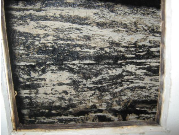
Kuva 78. Rakenneavaus tilan K-56 maanvastaisessa seinässä. Avauksesta havaittavissa kipsilevy, jonka takana on vaneri.
