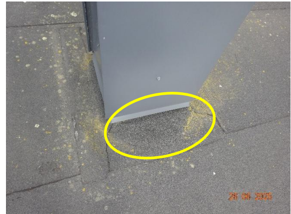
Kuva 121. PK 20 kohdalla oleva kaasutasku luokkasiiven katolla.
