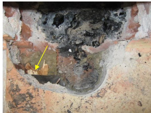
Kuva 2. Kuvassa vasemmalla patteriputken suojapaperi (keltainen nuoli), alimman laatan alla oleva täyttökerros on painunut.
