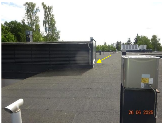
Kuva 124. IV-konehuoneen luokkasiiven puoleisessa päädyssä katolla on rako kattokermin seinällenoston liituskohdassa (keltainen nuoli).
