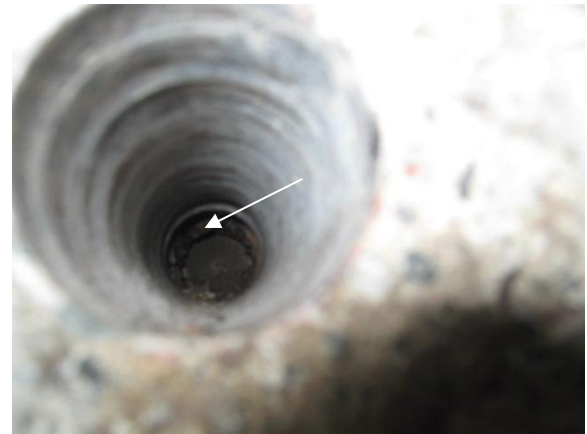
Kuva 77. RA-VS-2 avaukseen porattiin reikä lämmöneristekerrokseen saakka. Kuvassa reiän pohjalla on piellä käsitelty korkkieriste (valkea nuoli).
