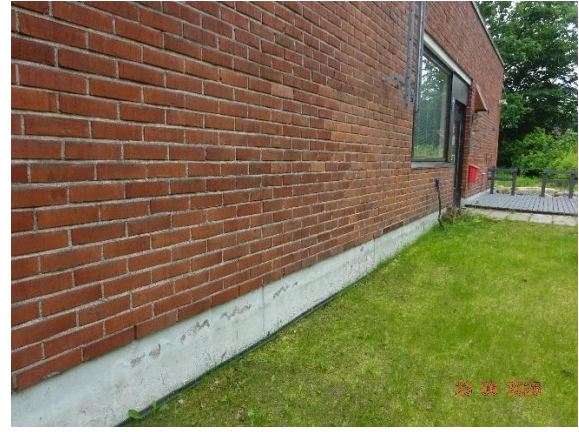
Kuva 139. Erikoisluokkasiiven koillispäätä. Nurmialue ulottuu sokkeliin saakka. Maanrajassa sokkelissa on havaittavissa patolevyn yläistä. sokkelissa on maali hilsillyt.
