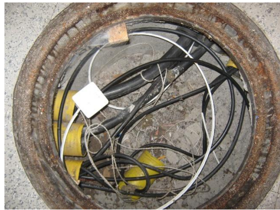
Kuva 8. Kaivossa on kiinteistöön tulevia sähkökaapeleita.
