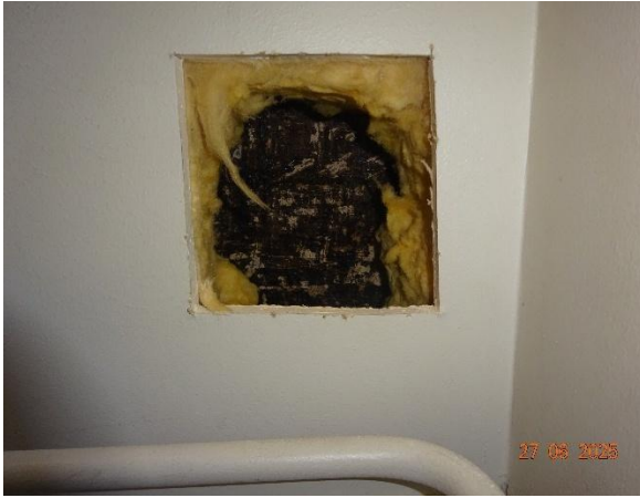
Kuva 53. Terveydenhoitajan huoneen K-39 RA-US3 ulkoseinän rakenneavaus. Seinän betonirakenteessa on bitumisively. Bitumisively oli huonokuntoisen näköinen.
