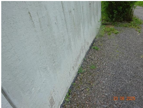
Kuva 142. Luokkasiiven luoteispäädyssä olevaa kivituhkapinnoitetta. Sokkeliin on asennettu maanalaiseen osaan patolevy.
