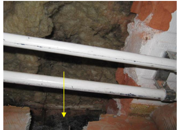
Kuva 60. Luokan 1–61 ulkoseinän rakenneavaus RA-US9. Sokkelin sisäpinnassa on pikisively (keltainen nuoli).
