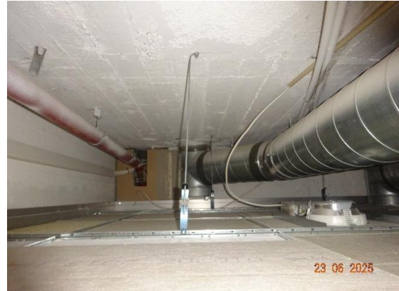
Kuva 101. Alakaton päällä oleva tila on puhdas. IV-kanavien pinnassa on pölynsidontamaalia.
