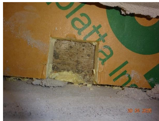
Kuva 2. SPU-eristeen alareunan ja alapohjan väliä ei ole tiivistetty uretaanivaahdolla.
