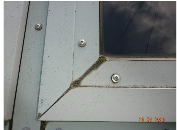
Kuva 123. Ikkunarakenteiden metalliliitoksissa on kasvustoa.
