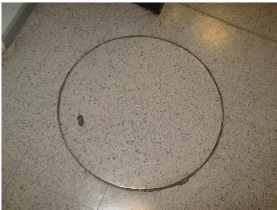
Kuva 7. Käytävällä K-53 oleva kaivo.
