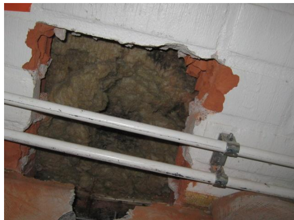
Kuva 2. Lämmöneristeen takana on havaittavissa sokkelin sisäpinnassa oleva pikisively.
