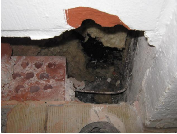
Kuva 57. Käytävän ulkoseinän rakenneavaus RA-US6. Sokkelin sisäpinnassa on pikisively.
