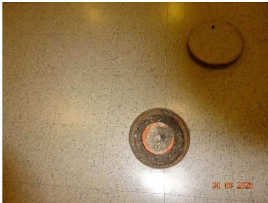
Kuva 9. Kellarikerroksen käytävän lattiapinnoitetta ja viemärin tarkastusaukko.
