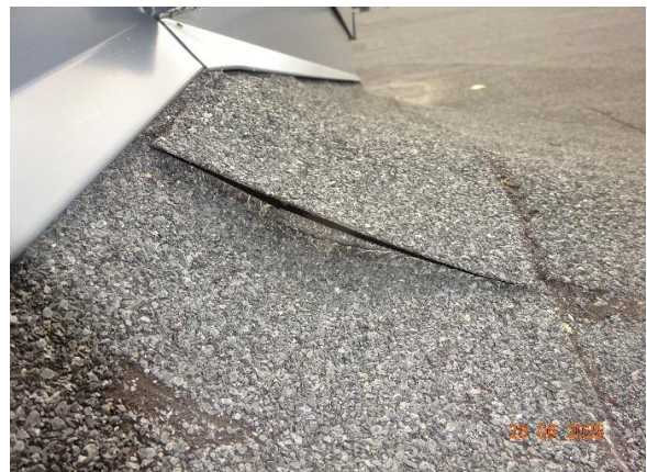
Kuva 125. Kattokermin liitoksessa oleva rako.
