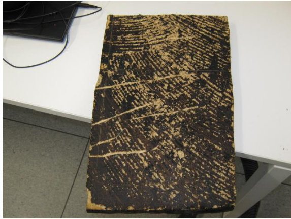
Kuva 91. Lattiapinnoitteen alla oleva las- tulevy on aikaisemmin ollut käytössä, koska pinnassa on pikiliimaa. Levyssä ei ollut silmämääräisesti havainnoituna mikrobikasvustoa.
