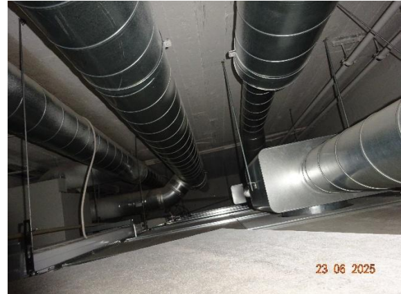
Kuva 113. Opettajainhuoneen 2-17 alakaton päällä olevaa tekniikkaa. IV-kanavien yläpinnassa on havaittavissa pölynsidontamaalia.
