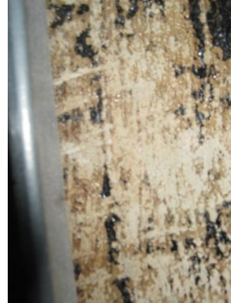
Kuva 79. Maanpaineseinän pinnassa on pikisivelyä, jota on hiottu pois.
