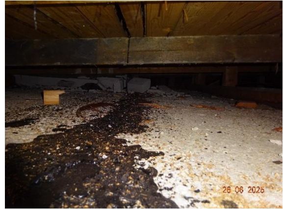
Kuva 119. Yläpohjan kantavan betonirakenteen pinnassa on kattokerman pikeä, jota on kermin asennusvaiheessa valunut ponttilautojen saumojen kautta betonin pinnalle.
