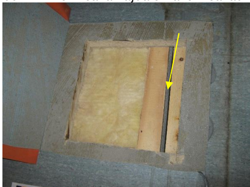
Kuva 1. SPK 115 alapohjanrakenneavaus. Kuvassa näkyy elementtien sauma, jossa eristeenä on solumuovikaista. Solumuovin ja oikeanpuoleisen alapohjapalkin välissä on rako (keltainen nuoli).
