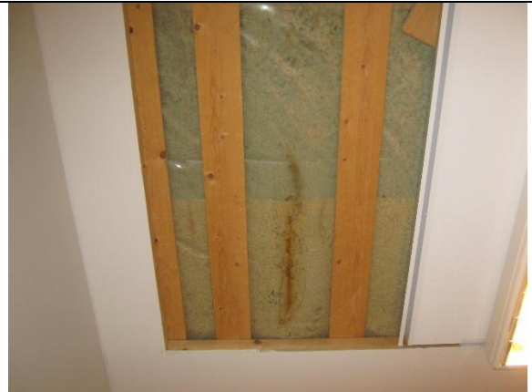
Kuva 77. Työtilan 108 yläpohjan rakenneavaus. Kuvassa näkyy kosteusjälki höyrynsulun päällä, kyseisestä kohdasta otettiin materiaalinäyte.
