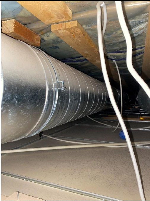
Kuva 72. Käytävällä 110 tilan 102 kohdalla olevan IV-kanavan päällä on runsaasti pölyä.
