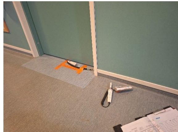
Kuva 40. Viiltomittaus VM6 tehtiin käytävälle 126 paikatun muovimaton kohdalle.
