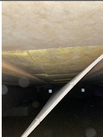
Kuva 31. Kipsilevy on irronnut kiinnityksistään.
