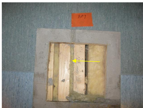
Kuva 1. Käytävän 126 rakenneavaus. Palkin ja lämmöneristeen välissä on rako. Kuvassa on nähtävissä myös elementtien sauma (keltainen nuoli).
