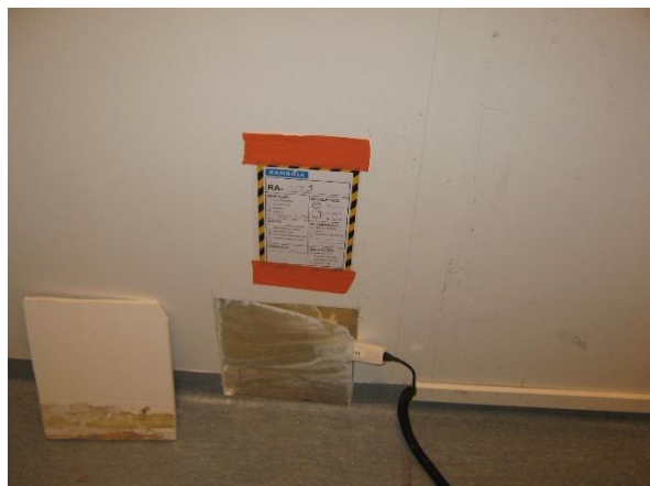
Kuva 2. Ulkoseinän lämmöneristekerroksesta mitattiin eristekerroksen kosteus.
