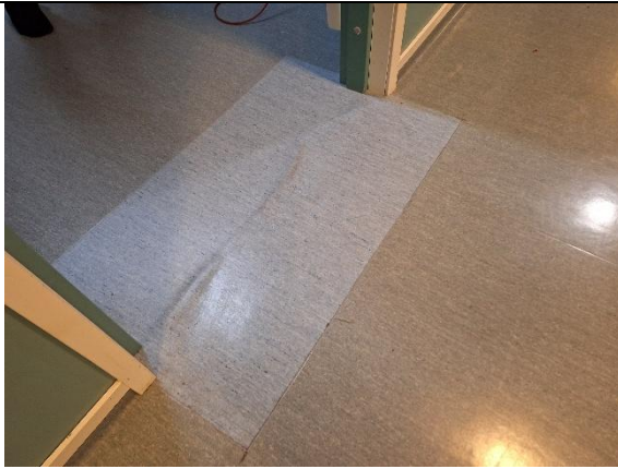
Kuva 19. Varasto 106:n kynnyksen kohdalla muovimatto on rityssä.
