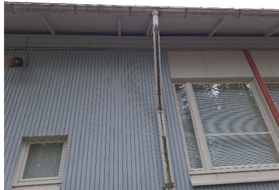
Kuva 93. Etupihan puolella oleva ränni ja syöksytorvi. Syöksytorven pinnassa on leväkasvustoa.
