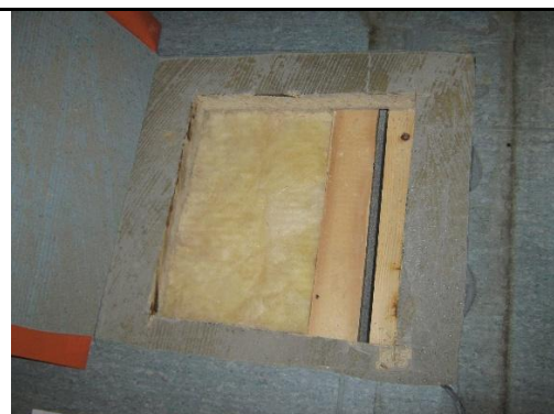
Kuva 38. Rakenneavaus AP6 SPK 115. Alapohjassa on väliseinän kohdalla elementtien liitoksessa näkyvissä solumuovieriste.
