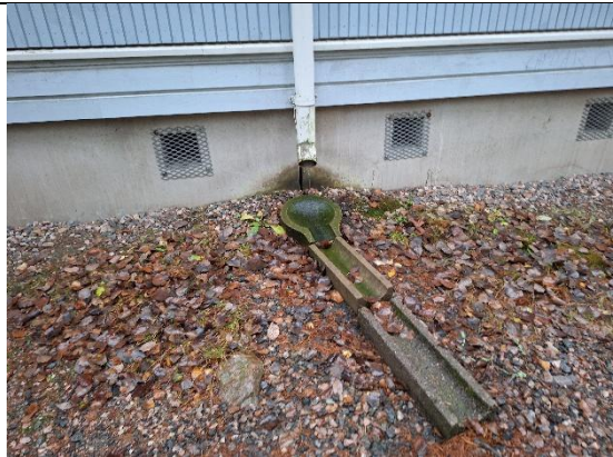
Kuva 94. Kohteessa ei ole sadeveden poistojärjestelmiä, vaan sadevedet ohjautuvat syöksytorvista betoniseen loiskekupiin, josta ohjautuvat maahan.
