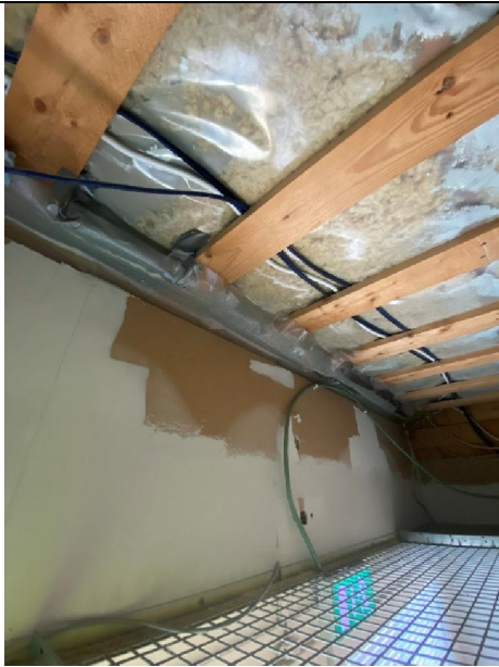
Kuva 68. Käytävän 126 eteläpäädyssä alakaton päällä oleva höyrynsulku on paikoin teipattu ilmastointiteipillä ulkoseinän höyrynsulkuun.
