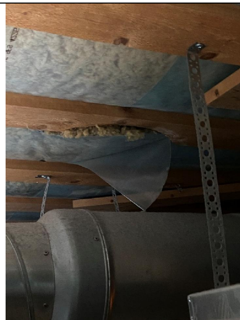
Kuva 67. Käytävän 126 alakaton päällä oleva höyrynsulku repsottaa, puhallusvillat saattavat valua avoimesta muovinkohdasta.
