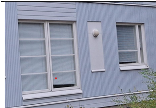
Kuva 49. Ikkunoiden vesipellitysten kallis- tukset ovat riittävät.
