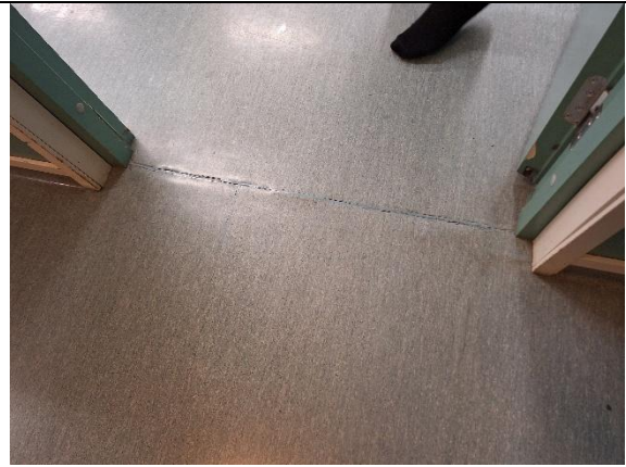
Kuva 20. Luokkahuone 103:n oviaukon kohdalla muovimattosauma on haljennut.
