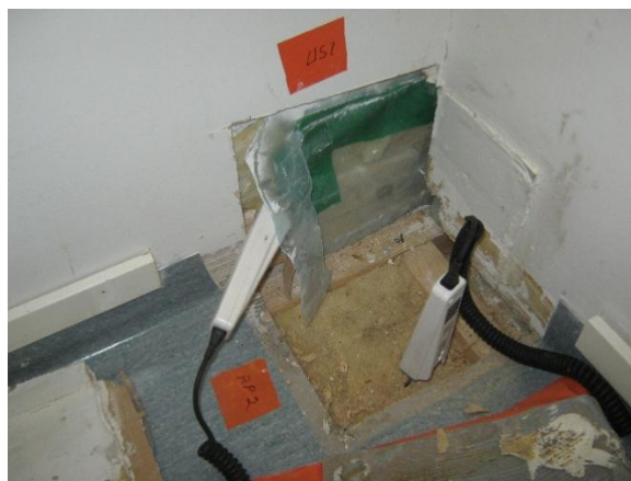
Kuva 2. Ulkoseinän lämmöneristeen kosteus mitattiin rakenneavauksen yhteydessä.
