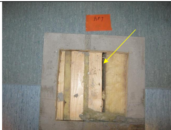
Kuva 33. Rakenneavaus AP1, käytävä 124. Alapohjassa ei ole höyrynsulkua eikä ilmansulkua. Kuva elementtien liitospaikasta. Alapohjan lämmöneristeessä on kylmäsilta (keltainen nuoli).
