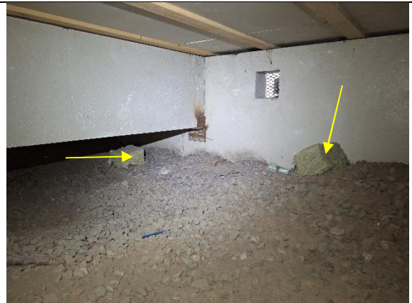
Kuva 28. Tuuletusaukoissa on ollut mineraalivillat, jotka on poistettu aukoista (keltainen nuoli).
