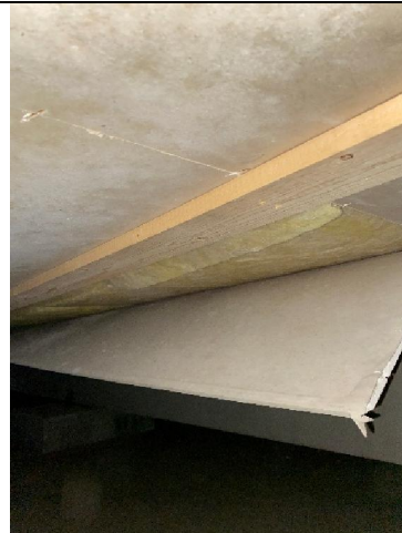
Kuva 32. Kipsilevyn irtoamisen syy johtuu siitä, että kipsilevyjen saumojen kohdalle annettu lauta ei ole sauman keskellä.
