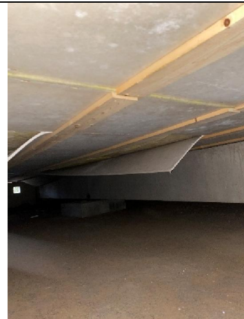
Kuva 30. Lämmöneristeen alapinnassa olevat kipsilevyt olivat paikoin irronneet.
