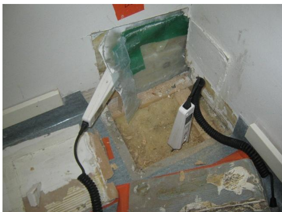
Kuva 1. Käytävän 126 rakenneavaus. Palkin ja lämmöneristeen välissä on rako.
