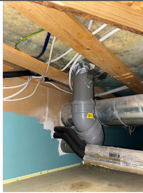
Kuva 69. Käytävän 126 alakaton päällä oleva viemärin tuuletusputken läpivienti yläpohjan höyrynsulusta on puutteellisesti tiivistetty.
