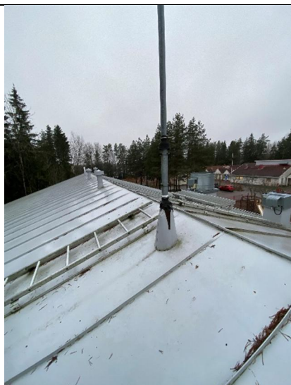
Kuva 90. Näkymä etelään päin. Antenni ja sen läpivienti kuvan keskellä.
