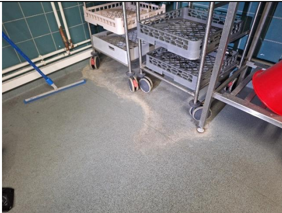
Kuva 21. Keittiön astianpesulinjaston kohdalla kosteusjälkiä lattiapäällysteessä.
