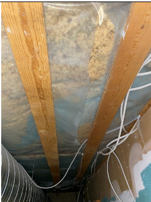
Kuva 70. Høyrynsulussa ei ole limitystä eikä teippausta. Eristeet pääsevät tippumaan yläpohjasta alakaton päälle.
