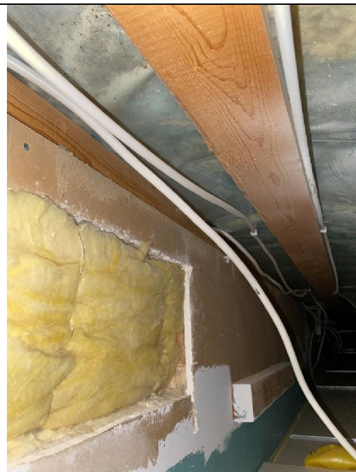
Kuva 71. Käytävän ja luokan 104 väliseinässä on verhoilulevyyn tehty aukko. Väliseinän eristeistä pääsee kuituja sisäilmaan.
