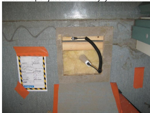
Kuva 2. SPK 115 alapohjan kosteus mitattiin rakenneavauksesta.
