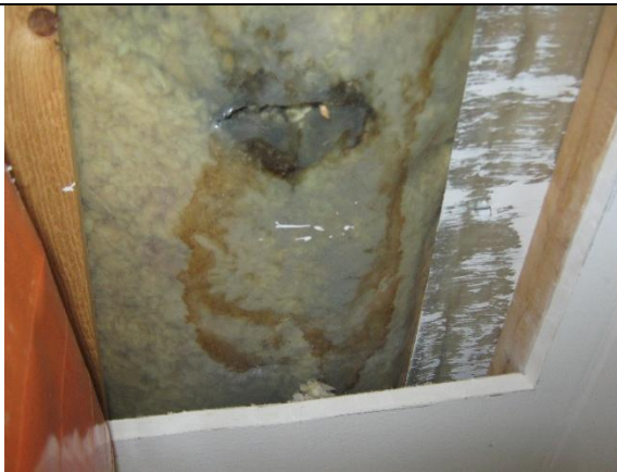
Kuva 78. Varasto / työtila 101 yläpohjan rakenneavaus. Kuvassa näkyy kosteusjälki höyrynsulun päällä, kyseisestä kohdasta otettiin materiaalinäyte.
