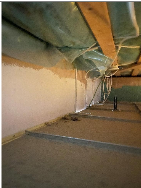
Kuva 66. Märkäeteisen 119 yläpohjan ja ulkoseinän höyrynsulkumuovin liitos. Muovien liitosta ei ole teipattu.
