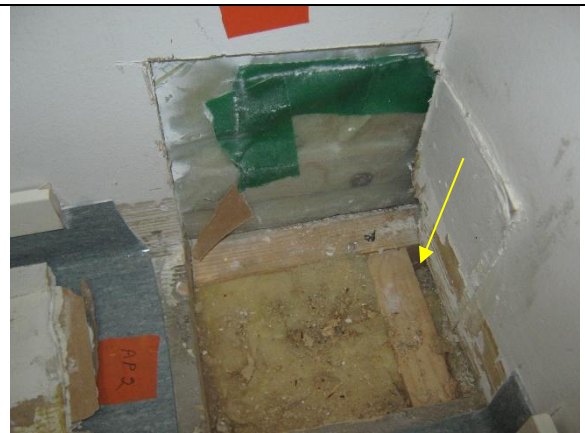
Kuva 34. Rakenneavaus AP2, varasto/työtila 101. Reunimmaisesta palkin ja ulkoseinän välissä oleva lämmöneriste on painunut (keltainen nuoli).
