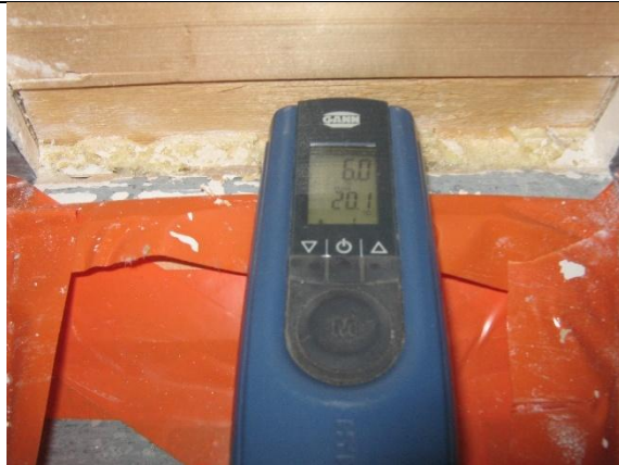
Kuva 54. Väliseinän rakenneavaus VAR/Työtila 105. Alaohjauspuun kosteus oli normaali.
