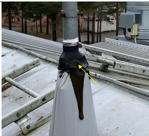
Kuva 91. Kuminen läpiviennin supistuskappale, joka on haljennut alasivulta (keltainen nuoli).
