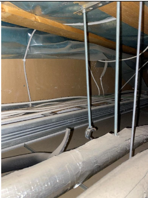
Kuva 74. Käytävän 110 alakaton päällä olevaa höyrinsulkumuovia, jota ei ole kiinnitetty mihinkään sekä erittäin pölyisiä putkien eristeitä.
