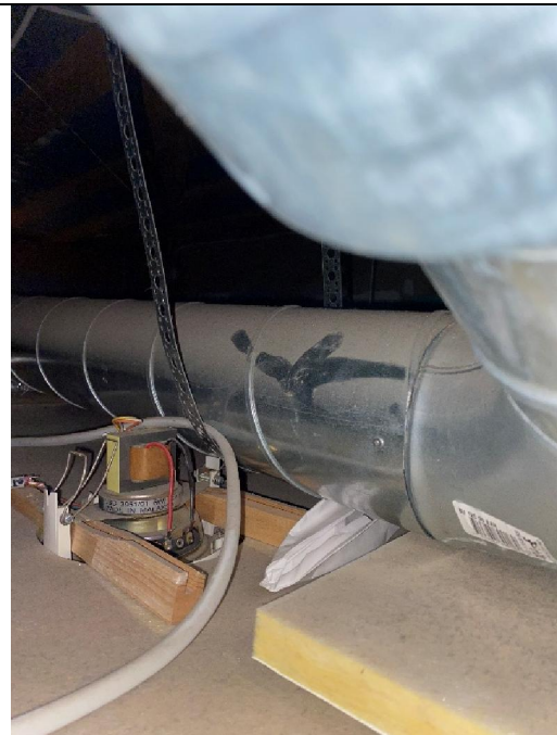
Kuva 75. Käytävän 110 päällä oleva IV-kanava, jonka pinnalla on runsas pölykeritys.
