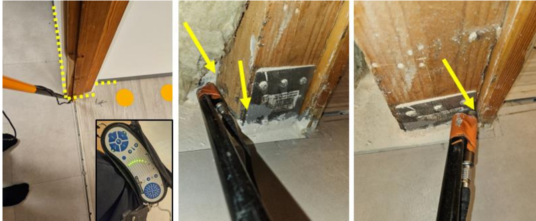
Kuvat 15. Voimakasta pistemäistä ilmavuotoa kantavan väliseinärakenteen kohdalta alapohja- ja oven karmiliittymästä. Rakenneavauksen perusteella merkkiaineikaasua pääsee kulkeutumaan rakenteeseen kantavien pystyrunkotolppien taustapinnoilta (väliseinää ja pystykarmia vasten) alueilta, joissa ei havaittu tiivistyspinnoitetta.
