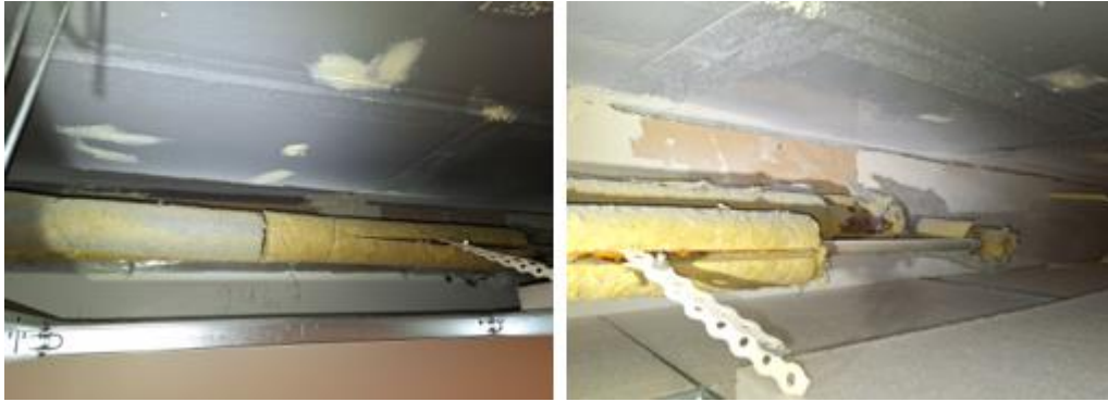
Kuvat 23. Varasto 16, alakaton yläpuolisessa tilassa on kohtalaisesti pinnoittamatonta mineraalivillaa putkieristeissä. Paikallisesti putkieriste on rikkoutunut / puutteellisesti asennettu.
