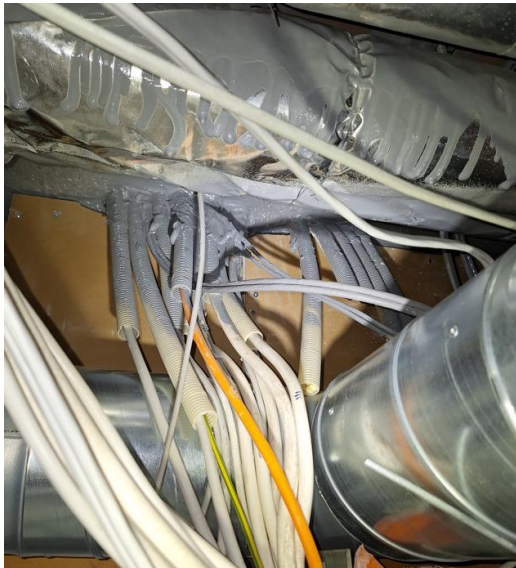
Kuva 24. Käytävällä 2 (varaston 16 oviaukon läheisyydessä) havaittiin alakattotilassa sähköjohtojen suojaputkia, joiden päitä ei ole tiivistetty.
