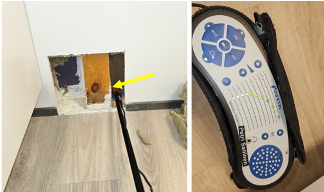
Kuvat 17. Voimakasta pistemäistä ilmapuottoa havaittiin keskeltä kantavaa väliseinälinjaa (märkätilan ja kuivan tilan liittymäkohta) pystyrunkotolpan liittymästä. Havaintojen perusteella tiivistyspinnoitetta ei ole ulotettu väliseinän ja pystyrunkotolpan liittymään (keltainen nuoli).
