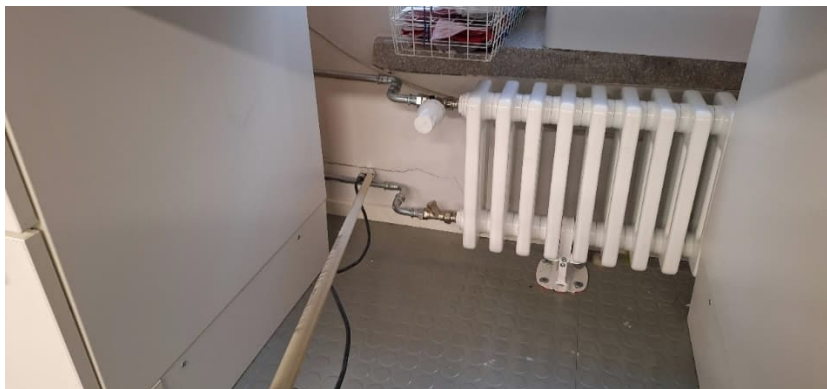
Kuva 26. Ulkoseinän halkeamasta ilmavuoto oli luonteeltaan merkittävä ja voimakkuudeltaan voimakas.
