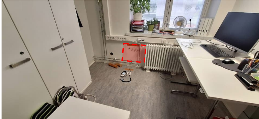
Kuva 20. Rehtorin huone 029. Ulkoseinässä todettiin paikallisesti kohonneita lukemia kuvaan punaisella rajatulla alueella (lukemat välillä 80–100). Seinän maalipinnoite oli ehjä ja siistikuntoinen.
