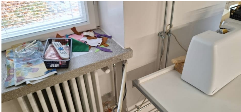
Kuva 27. Ulkoseinä- ja ikkunapenkin sekä ikkunakarmin liittymistä havaittiin luonteeltaan pistemäistä ilmavuotoa, joka oli voimakkuudeltaan heikkoa ja kohtalaista.
