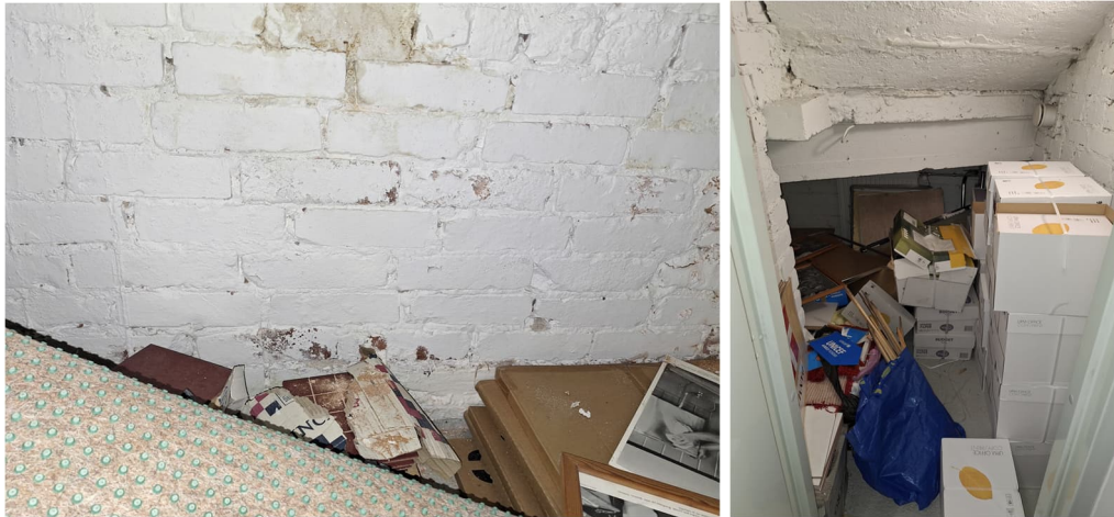
Kuvat 12. Kellarikerroksen porrashuoneen 038 yhteydessä olevan portaikon alustilassa (tekninen tila 040) havaittiin tiilimuuratun ulkoseinän pinnalla vähäisiä viitteitä kosteusrasituksesta. Tilassa oli runsaasti tavaroita varastoituna maanvaraisia rakenteita vasten.
