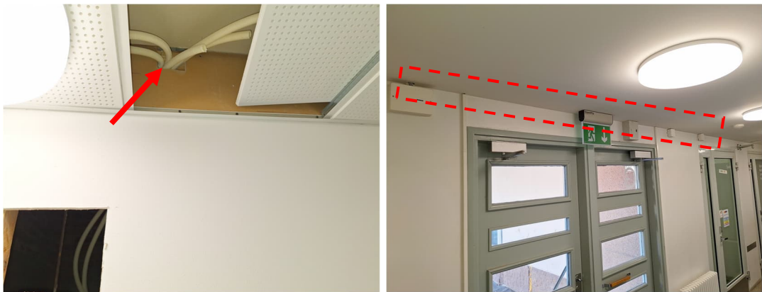
Kuvat 32. Kiinteästä alakattojärjestelmästä on avonaisia läpivientejä portaikon kohdalla olevaan kipsilevyrakenteiseen alakattojärjestelmään sekä eteistilaan. Läpivienneistä todettiin merkkisavulla tarkasteltuna kiinteästä alakattotilasta ilmavirtaus sisäilmaan päin.
