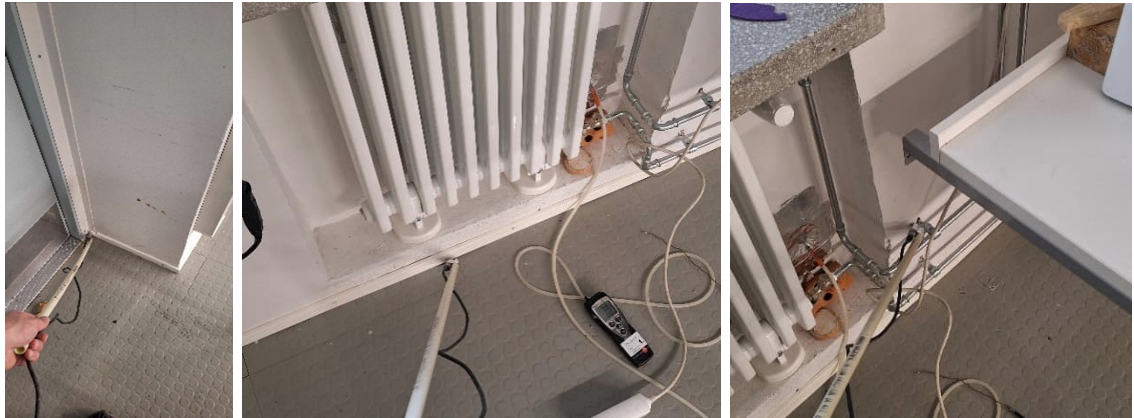
Kuvat 25. Ilmavuotoja havaittiin ulkoseinän ja ulko-oven liittymässä, alapohja- ja ulkoseinäliittymässä sekä ulkoseinän putkikannakkeista. Ulkoseinän ja alapohjan liittymässä vuoto oli merkittävä ja voimakkuudeltaan kohtalainen–voimakas. Kannakkeiden vuodot olivat pistemäisiä heikkoja–kohtalaisia. Normaalitilanteessa vastaavat vuodot myös havaittiin, mutta niiden voimakkuus oli lievempi.
