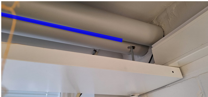
Kuva 28. Ulkoseinän ja alaslasketun alakaton liittymästä havaittiin merkittävää ilmavuotoa putkien takaa, joka oli voimakkuudeltaan kohtalaista. Vuotoalue korostettu kuvaan sinisellä värillä.
