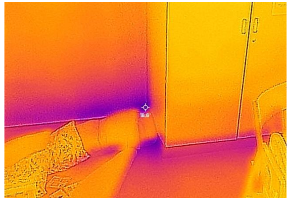
Kuva 11 Tila 151, päätyseinällä alin lämpötila oli 18,6 °C.
