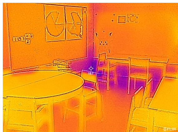
Kuva 17 Tila 107, ulkoseinien kulmauksessa pistemäinen lämpötila oli 19,1 °C. Oleskeluvyöhykkeellä lämpötila oli 21,5 °C.
