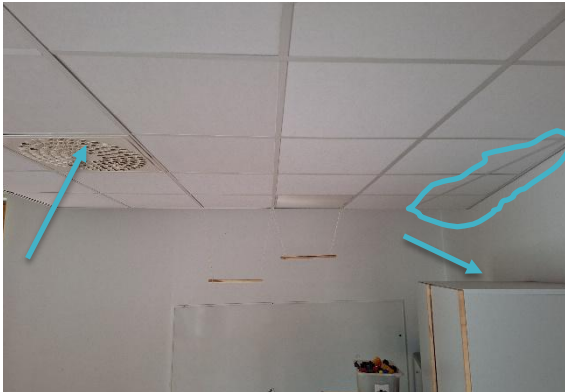
Kuva 45 Tilan 209 tuloilman päätelaite ja näytteenottopiste K1.2, jossa oli kuituja 0,43 kpl/cm 2 . Näytteenottopisteen yläpuolella on leikattuja äänenvaimennuslevyjä.
