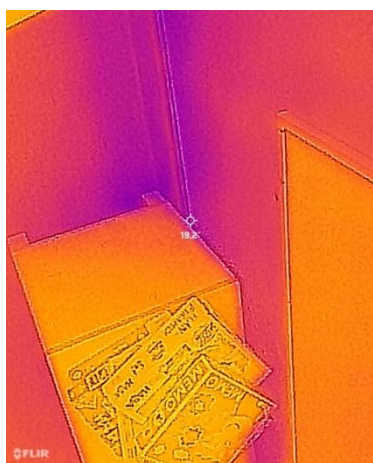
Kuva 18 Tilan 107 toinen kylmempi pistelämpötila, 19,2 °C, tilan etukulmassa.
