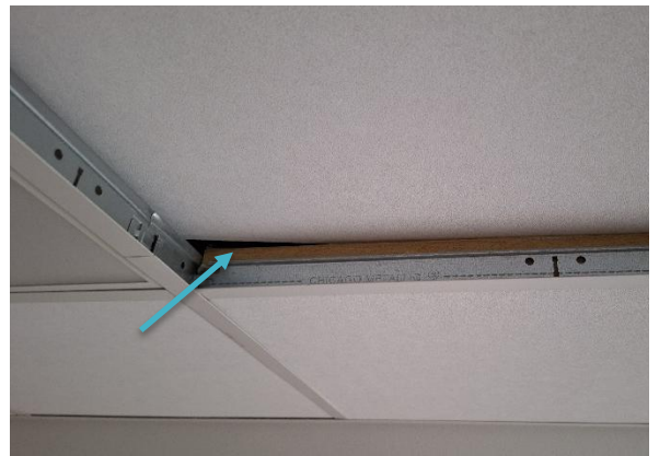
Kuva 48 Tila 209 alaslaskussa on leikattuja äänenvaimennuslevyjä, joiden reuna on avoin.
