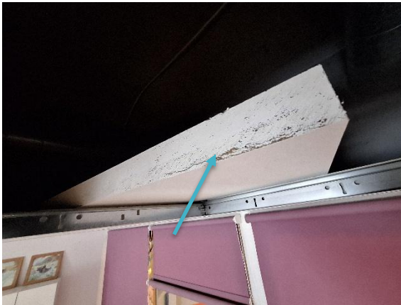
Kuva 43 Tila 149, äänenvaimentimen reuna on hieman rikkoutunut korkean kaapin luona.
