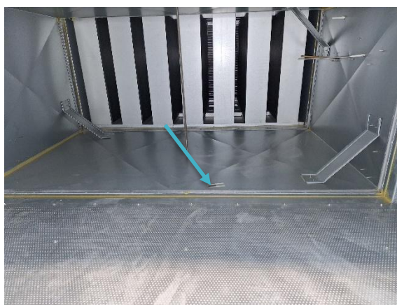
Kuva 54 Ilmanvaihtokoneesta otettu kuitunäyte K5: 7,4 kpl/cm 2 . Äänenvaimennusmateriaali on suojattua.
