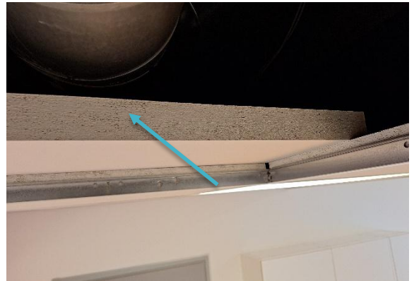
Kuva 38 Tilan 146 äänenvaimentimet on päällystetty reunoilta ja yläpinnastaan.
