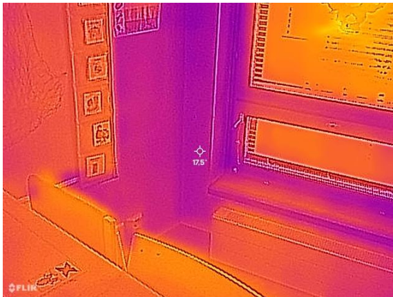
Kuva 22 Tilan 209 alin pistemäinen lämpötila oli ulkoseinien kulmauksessa 17,5 °C.
