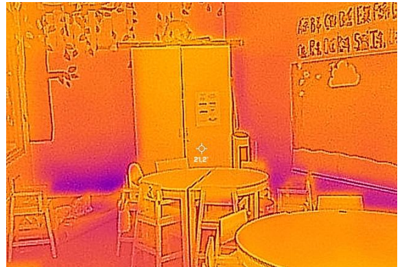
Kuva 9 Tilan 151 lämpökamerakuva. oleskelu- vyöhykkeellä lämpötila oli 21,2 °C.
