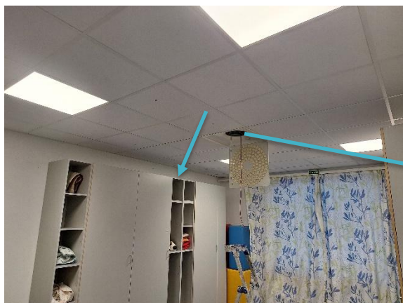
Kuva 49 Tila 230, tuloilman päätelaite avoinna. Kaapin päältä otettu näyte K4.3 ylitti toimenpiderajan.
