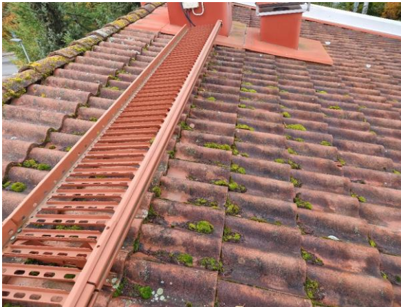
Kuva 189 C-osan tiilikatteissa esiintyy sammaloitumista.
