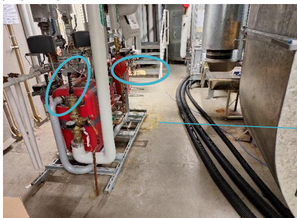
Kuva 149 Lämmityksen painesäiliöiden kohdalla on ollut vettä. Ulko-oven portaikon alla oli kohonnuttu pintakosteutta: 70–78.
