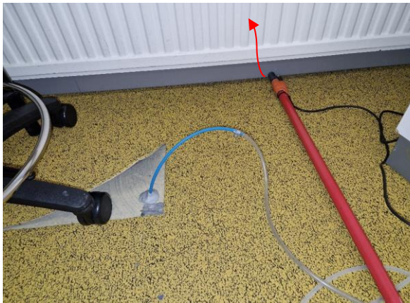
Kuva 72 Luokassa 166 yksittäinen ilmavuotokohta alapohjan ja ulkoseinän liittymässä.
