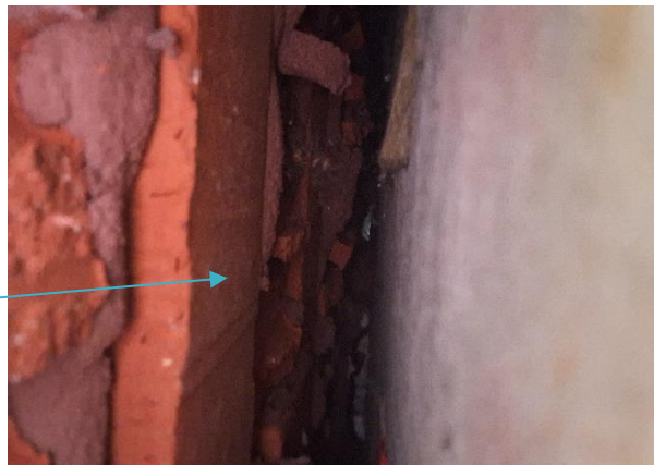
Kuva 110 Avaus US5, tuuletusrako oli 50 mm eivätkä laastipurseet ota kiinni tuulensuojavillaan.
