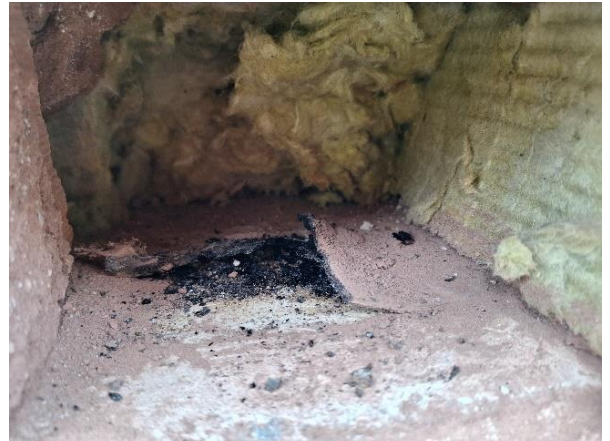
Kuva 42 Avaus US5, sokkelia vasten ole bitumikermi.
