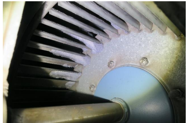
Kuva 280 Poistopuhaltimen siipipyörät ovat likaantuneet pölystä.
