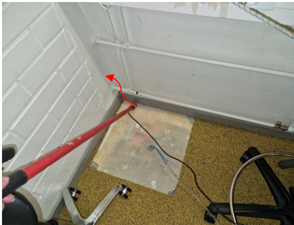
Kuva 74 Pienryhmätilan 124 alapohjan ja ulkoseinän liittymässä havaittiin yksittäinen, lievä ilmavuotokohta.
