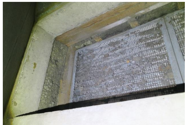
Kuva 262 Ulkoilmanotto on likaantunut. Ulkoseinäeristeet ovat näkyvissä ulkoilmanoton reunoilla.
