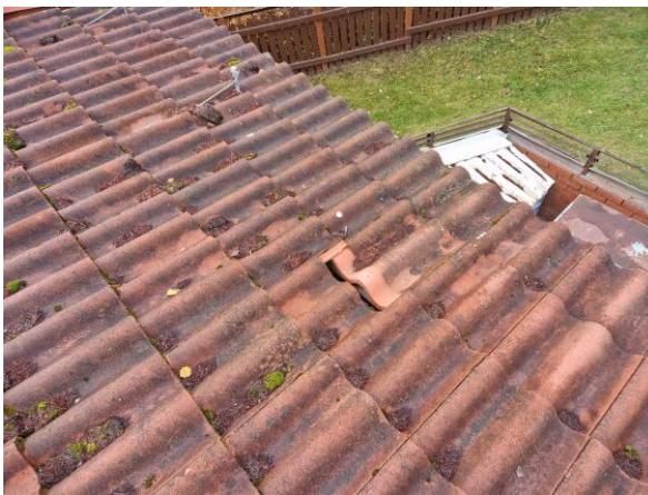
Kuva 191 Konehuoneen 187 kohdalla kattotiili on siirtynyt pois paikaltaan, minkä johdosta sadevesiä pääsee kulkeutumaan alus- katteelle, ja sitä kautta julkisivun pin- taan.
