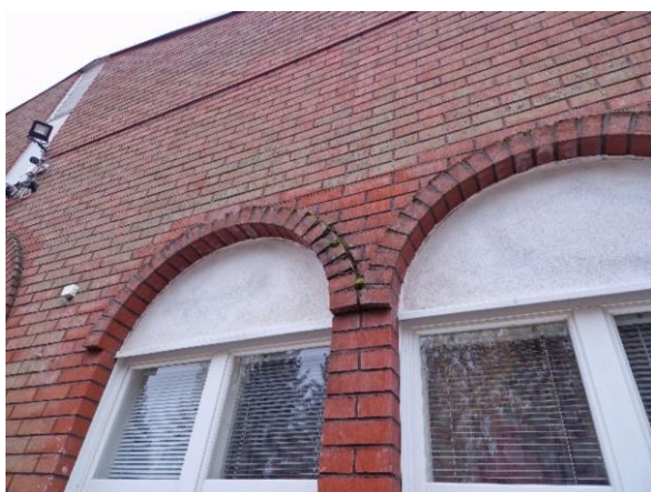
Kuva 115 Ikkunoiden yläpuolella on lämpörapattuja julkisivuosuuksia.
