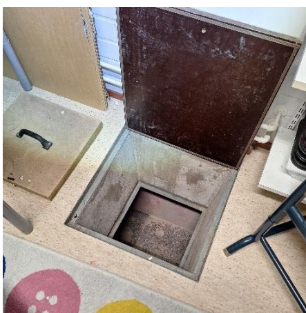
Kuva 43 Laajennososan alapohjaluukku varastotilassa 210. Luukut olivat epätiiviviitä.
