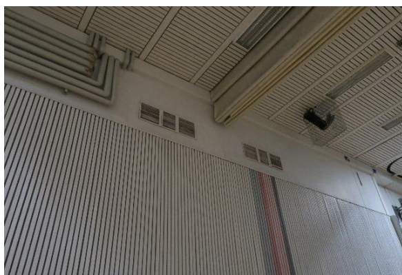
Kuva 300 Liikuntasalin poistoilmasäleiköissä on li- kakertymää.
