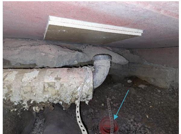
Kuva 56 Luokkatilan 181 kohdalla ryömintätilan sisäilmassa esiintyi viemärin hajua. Viemärin tulppaus on irronnut. Tulppa osoitettu sinisellä nuolella.
