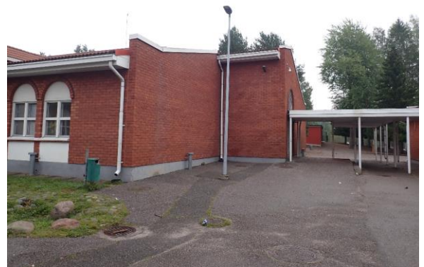
Kuva 13 Asfalttipinnoilla havaittiin runsaasti paik- kakorjattuja alueita. Kuvassa myös piha-alueen kaivoja.
