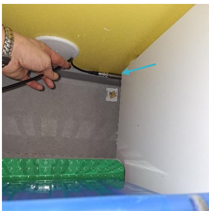
Kuva 161 Selvä vuotokohta kaapin takaa tilassa 246.
