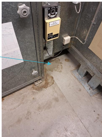
Kuva 148 Päädyssä on kosteusjälkiä, joiden kohdalla isoimmat lukemat: 82–85.
