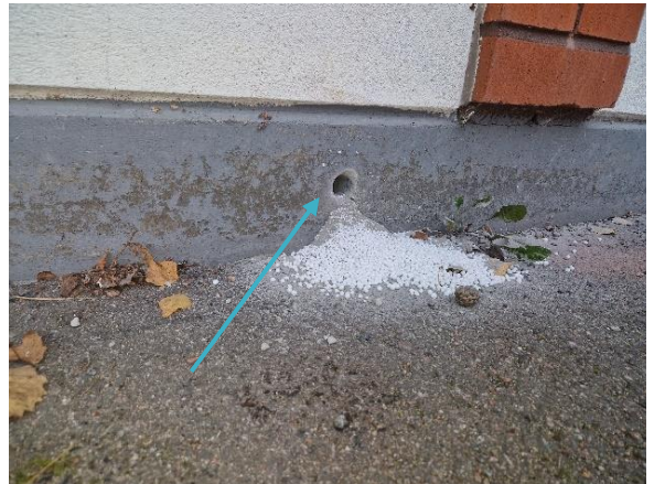
Kuva 58 Laajennososan sokkelireikä (SOK3), eristeenä oli myös EPS-eristettä.
