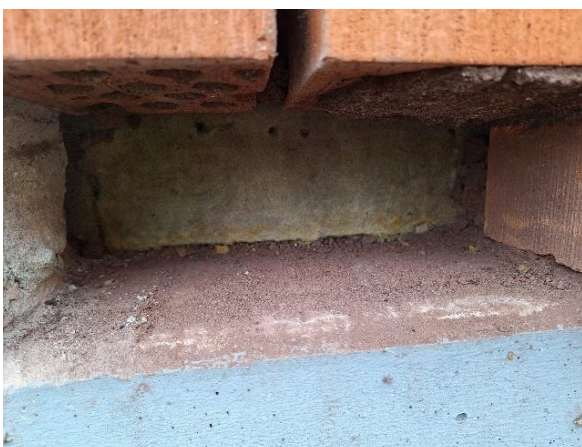
Kuva 45 Julkisivun ja lämmöneristeen välissä ilmarako oli 30 mm ja laastipurseet ottivat paikoin kiinni tuulensuojalevyyn.
