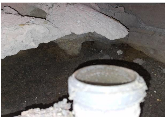
Kuva 57 Viemäriputken tulppaus oli irronnut.
