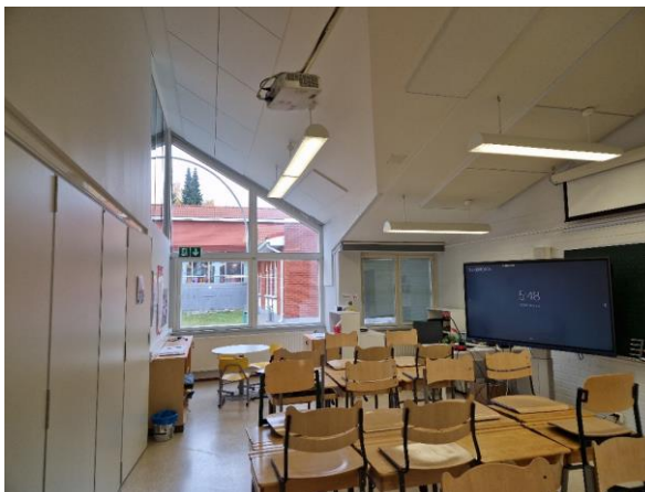
Kuva 239 Yleiskuva luokkatilasta 214b, jonka kohdalla on tapahtunut vesikattovuoto. Lähötietojen perusteella vesikattovuodoista aiheutuneet vauriot on korjattu.
