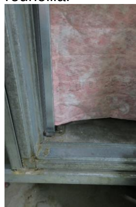
Kuva 264 Suodattimissa ei havaittu merkittävää ohivuotoa, mutta suodatin-kammion pohjalla on jälkiä kosteusrasituksesta.
