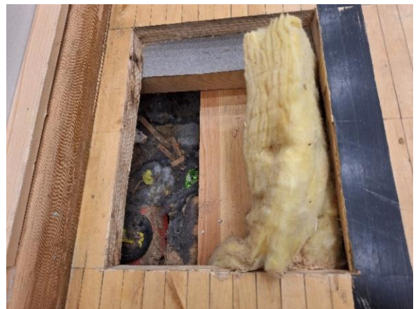
Kuva 32 Lattian alle on kertynyt paljon roskaa seinien vierustoille.
