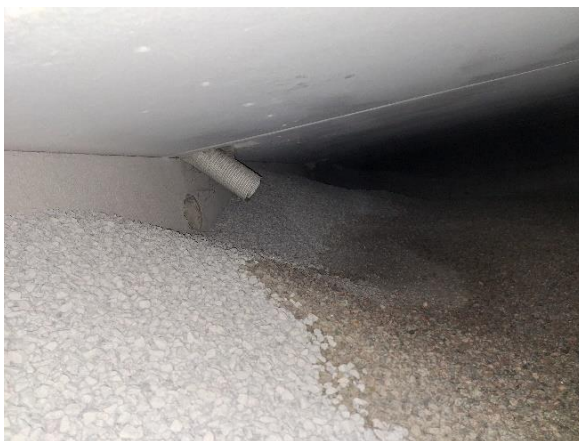
Kuva 49 Korvausilma-aukko on tehty salaojaput- kella. Tarkempi tarkastelu tehtiin vain yhdessä kohtaa.
