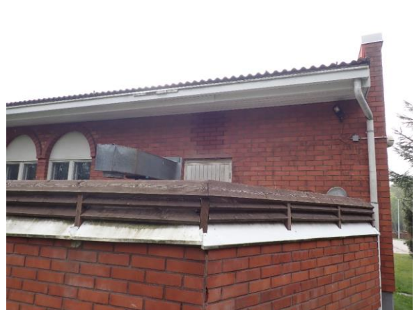
Kuva 192 Konehuoneen 187 ulko-oven yläpuo- lella ulkoseinässä on yksittäinen vesi- kattovuotoon liittyvä vauriojälki.
