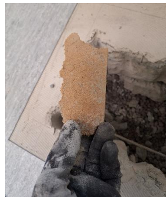
Kuva 8 Betonilaatan ja kevytsoran välissä on vaneri.
