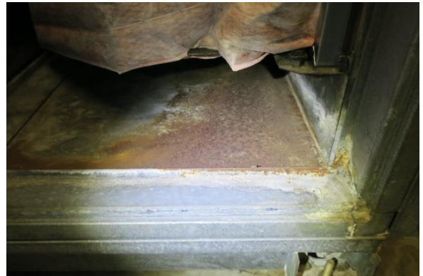
Kuva 269 Suodatinkammio on merkittävästi ruostunut kosteusrasituksen vuoksi.
