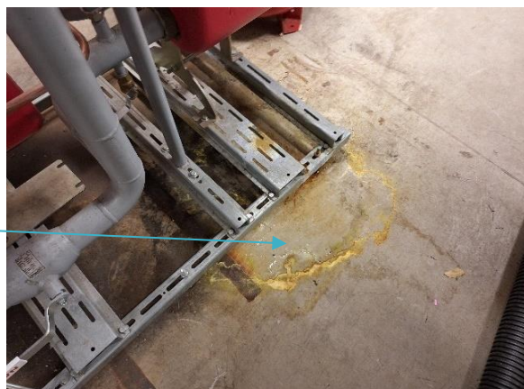
Kuva 150 Kosteusjälki painesäiliöiden luona; kohta oli nyt kuiva pintamittarilla: 58–63.
