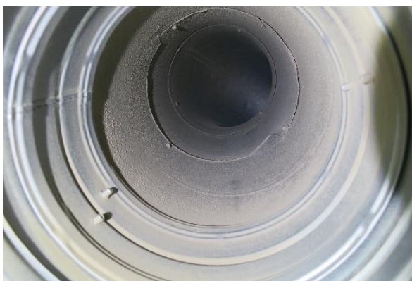
Kuva 299 Alkuperäisosan poistoilmakanavissa on tavanomaista likakertymää.
