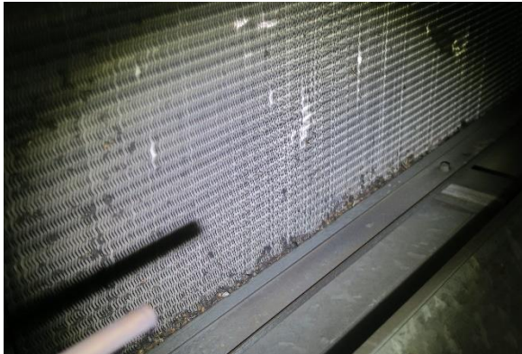
Kuva 272 Lämmityspatterissa on epäpuhtauksia.
