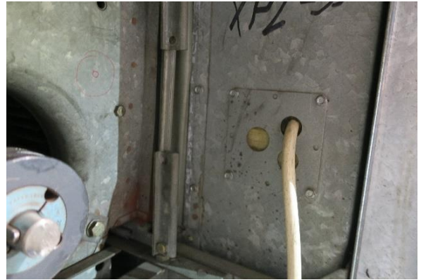
Kuva 266 Puhallinkammiossa on läpivienti, joka voi toimia mineraalikuitulähteenä.
