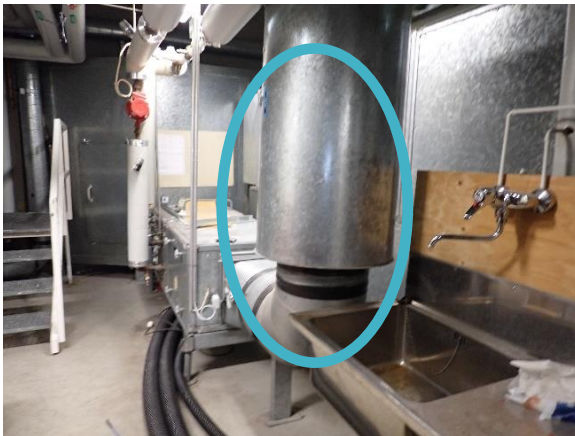
Kuva 267 Koneen jälkeen tuloilmakanavassa on kanavaäänenvaimennin, joka voi toimia mineraalikuitulähteenä.
