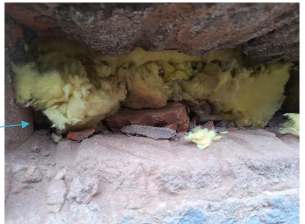
Kuva 108 Eristevilla oli aistinvaraisesti kuivaa. Lämmöneristeen ja julkisivutiilen välissä ei ole tuuletusrakoa.
