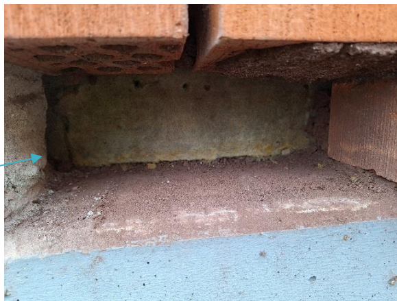
Kuva 114 Julkisivun ja lämmöneristeen välissä ilmarako oli 30 mm ja laastipurseet ottivat paikoin kiinni tuulensuojalevyyn.
