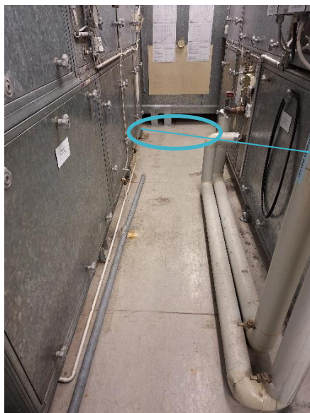
Kuva 147 IV-koneiden välissä pintakosteus 68–72 ja päädyssä 79–85.
