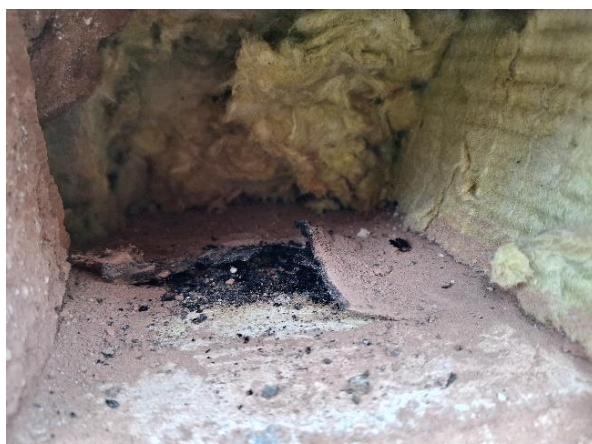
Kuva 112 Sokkeliä vasten ole bitumikermi.
