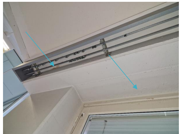
Kuva 240 Luokkatilan 214b kohdalla yläpohjan alapinnassa on edelleen vesikattovuotojen aiheuttamia vauriojälkiä.
