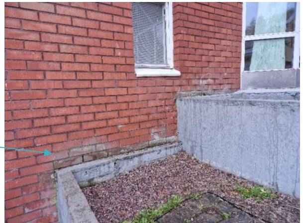
Kuva 106 Ns. sisäpihalla olevien istutusaltaiden läheisyydessä julkisivupinnat ovat selvästi kosteusvaurioituneet. Liittymäkohdissa esiintyy sammaloitumista.
