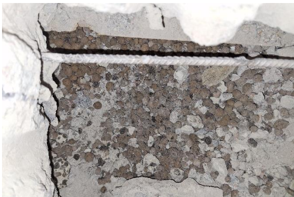
Kuva 7 Betonin alla oli yli 310 mm kevytsoraa.
