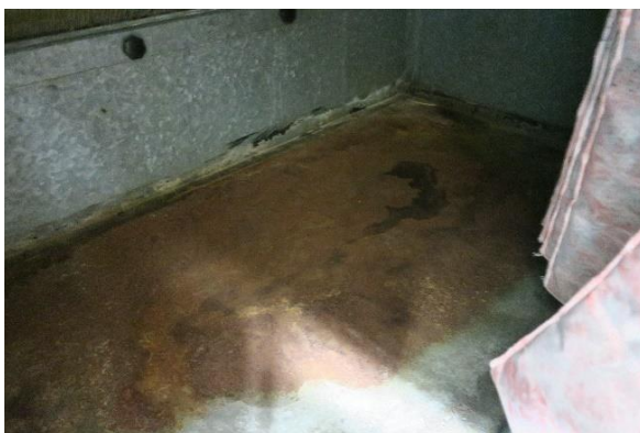
Kuva 270 Suodatinkammio on kauttaaltaan ruostunut.
