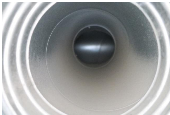
Kuva 304 Laajennusosan poistokanavissa on isompaa likakertymää (TK5).
