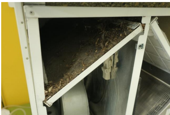
Kuva 291 Koneen esisuodatin on merkittävästi likaantunut.
