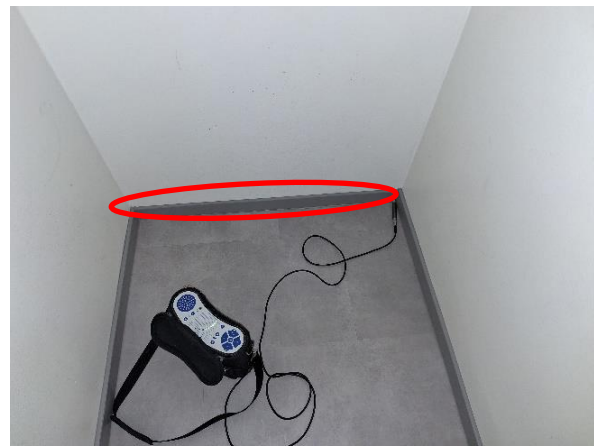
Kuva 160 Selvää ilmavuotoa entisen asunnon puoleisen tyhjillään olevan varastotilan 247 lattian ja väliseinän liittymäkohdista.
