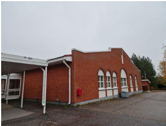
Kuva 12 Asfalttipinnoilla havaittiin runsaasti paik- kakorjattuja alueita.
