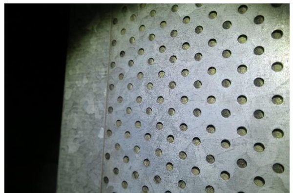
Kuva 275 Reikäpellin alla on mineraalivillaa, joka on suojattu ainoastaan ohuella harsolla.
