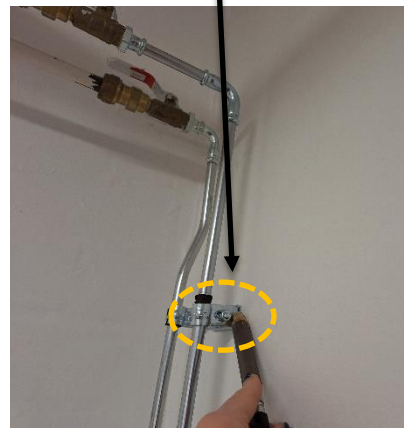
Tehostetussa alipaineessa kohtalaista ilmavuotoa yhdestä putkikannakkeesta.
