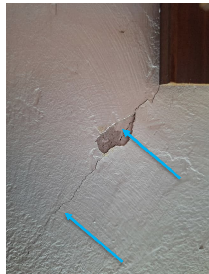
Kuva 38 Ikkunan vasemmassa alakulmassa oli pieni halkeama sisäkuoressa.
