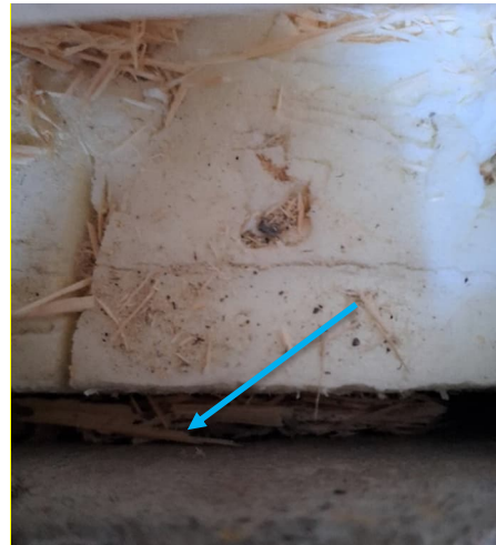
Kuva 54 US-L1, SPU-eristeen ja sokkelin välissä on pieni rako, joka oli täynnä alaohjauspuusta irronnutta puusilppua.
