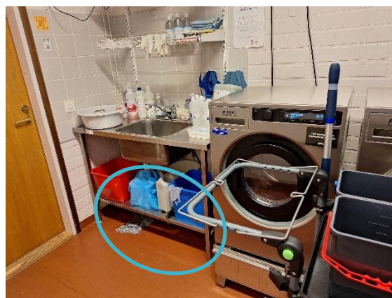
Kuva 44 Pyykkitilan H11 peuspisteen alla ja edessä on kohonnutta pintakosteutta: 88...110. Väliseinän toisen puolen tilassa (H8) pintakosteus on lievästi koholla: 80...85.
