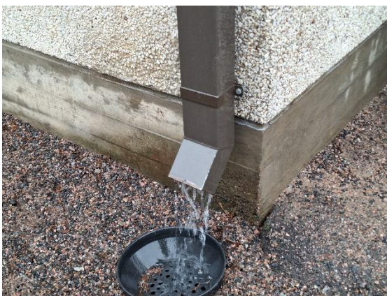
Kuva 12 Tilan H51 syöksy kastelee sokkeliosaa vesisateilla.
