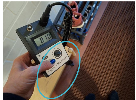
Kuva 40 Eteisen H32 vesipistettä vastapäätä olevan penkin luona oli hieman kohonnutta pintakosteutta: 80...83.
