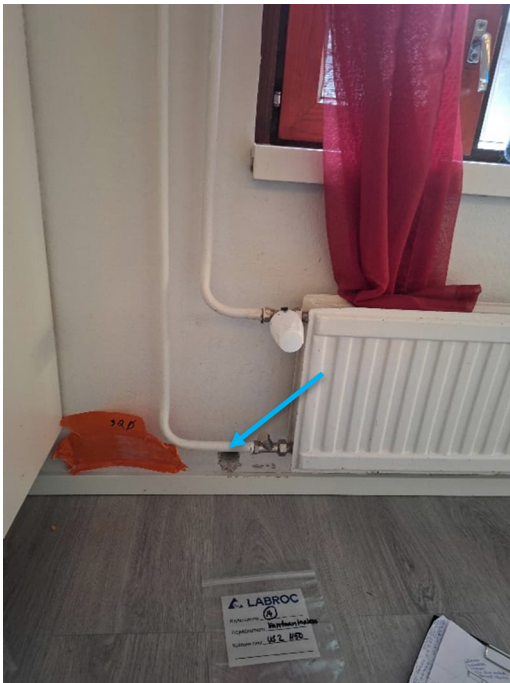
Kuva 11 US2 tilaan H50, ikkunan alapuolelle.
