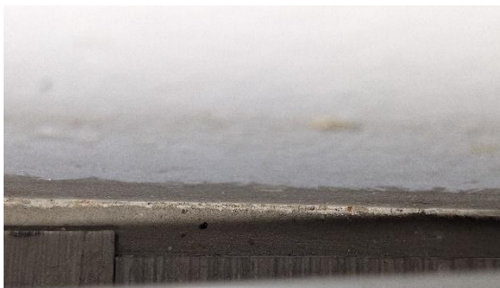
Kuva 36 Aulatilán L11 ja tilán L18 oven kohdalla on näkyvissä uusi tasoite.
