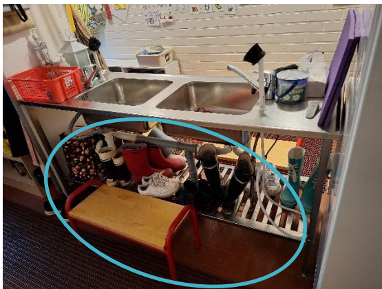
Kuva 39 Eteisen H32 vesipisteen alla ja vieressä oli kohonnutta pintakosteutta: 80...90.
