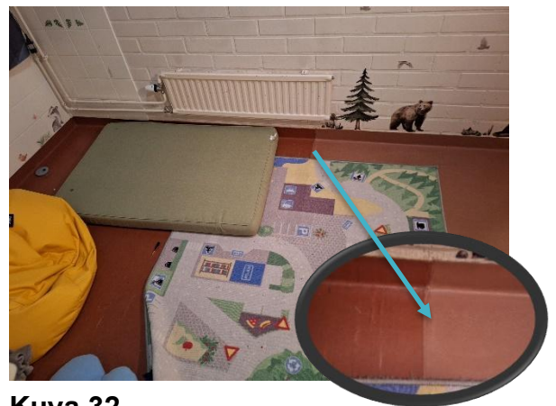
Kuva 32 Tila H36 on vanha vesileikkikiti. Tummempi matto tilan perällä on uusittu; vaaleampi on vanha märkätilamatto.
