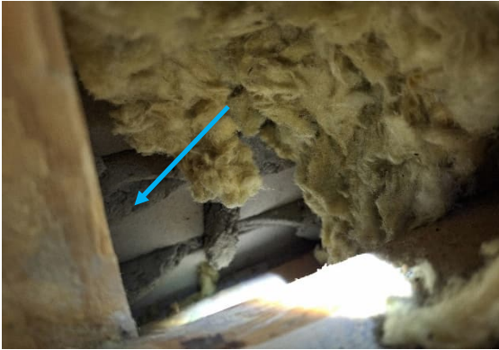
Kuva 41 US9. Sisäkuori eli kalkkiahiekkatiilen rappauspurseet näkyvissä.
