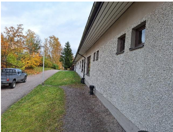
Kuva 10 Pohjoispäätyä, jossa maanpinta laskee rakennuksen viereltä pois päin.
