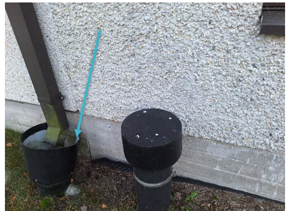
Kuva 11 Laajennusosalla on patolevytys. Sadevesikäivön ympärille on lisätty nosto-osa, joka on auennut takaosasta.
