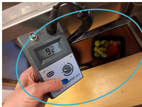
Kuva 42 Eteisen H39 vesipisteen alla ja vieressä on kohonnutta pintakosteutta.
