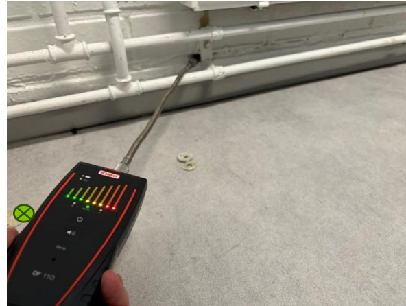
5. Alipaineistetuissa olosuhteissa havaittiin merkittävää ilmavuotoa yksittäisestä patterinkannakkeesta.
