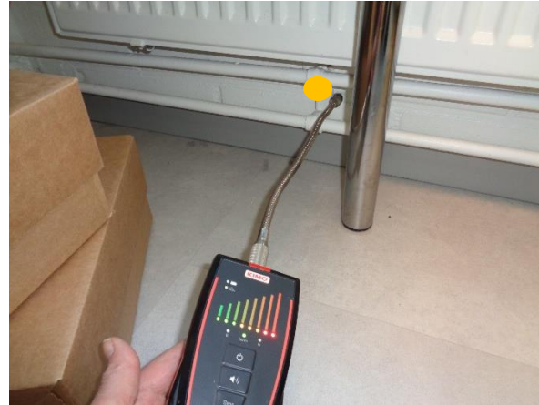
5. Tiilisäumasta patterinkannakkeen vieressä todettiin vähäistä ilmavuotoa.
