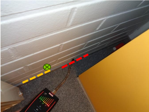
1. Ulkoseinän merkkiainekokeessa todettiin lattialistan alta tiilisaumojen kohdalla osin merkittävää ja vähäistä ilmavuotoa kaasunsyöttökohdan läheisyydessä normaaleissa sekä alipaineistetuissa olosuhteissa.
