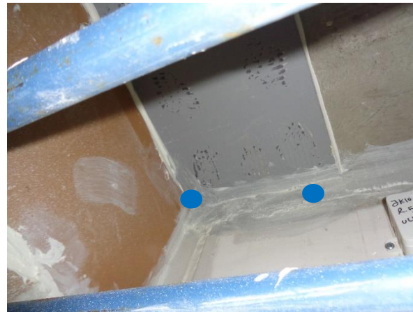
5. Yläpohjan ja ulkoseinän liittymässä havaittiin kaksi pistemäistä ilmavuotokohtaa (vasemman nurkan vuotokohta havaittiin yläpohjan merkkiainekokeessa).
