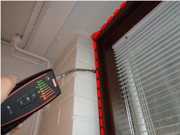
4. Alipaineistetuissa olosuhteissa todettiin merkittävää laaja-alaista ilmavuotoa karmien ja ulkoseinän liittymistä.
