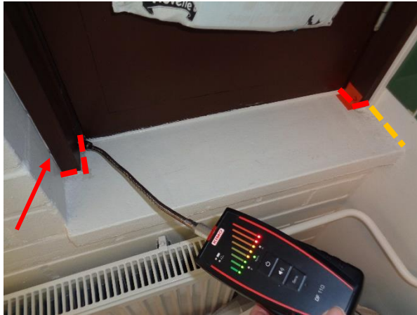
1. Oikeanpuoleisen tuuletusikkunan karmien ja ikkunapenkin/ulkoseinän liittymistä todettiin merkittävää rakomaista ilmavuotoa. Nuolen osoittamasta kohdasta havaittiin aistinvaraisesti mikrobiperäistä hajua.
