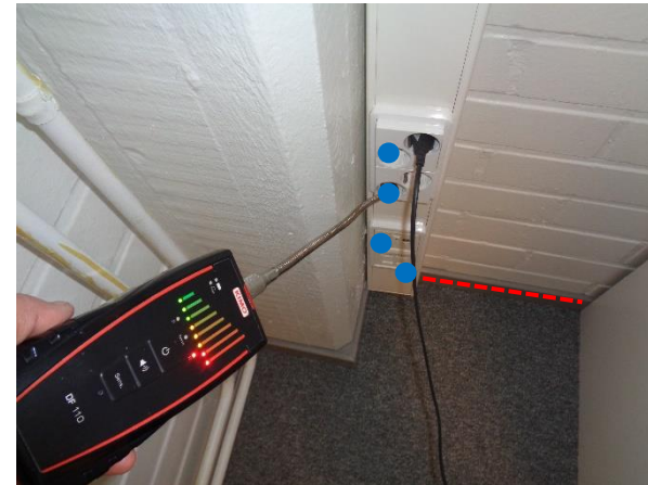
9. Tilan ollessa alipaineistettuna havaittiin vähäisiä ilmavuotoja sähkökourusta. Alapohjan ja ulkoseinän liittymästä todettiin merkittävää rakomaista vuotoa.
