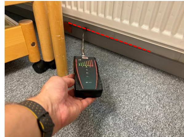
12. Alapohjan ja ulkoseinän liittymästä havaittiin merkittävää rakomaista ilmavuotoa tilan ollessa alipaineistettuna (läntinen ulkoseinälinja).
