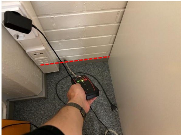
10. Alapohjan ja ulkoseinän liittymästä havaittiin merkittävää laaja-alaista ilmavuotoa tilan ollessa alipaineistettuna (pohjoinen ulkoseinälinja).
