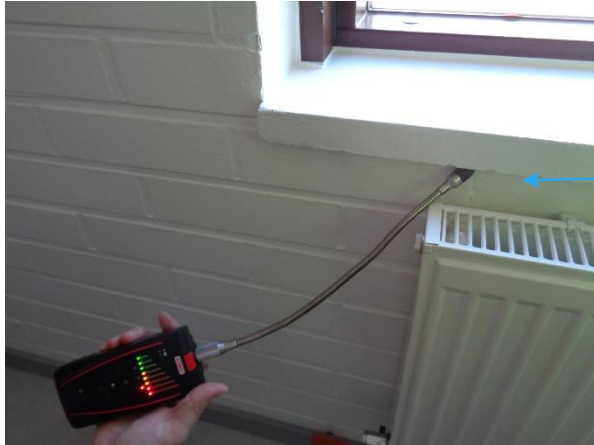
7. Ulkoseinän tiilimuuratun sisäkuoren laastisaumassa havaittiin merkittävä vuotokohta.
