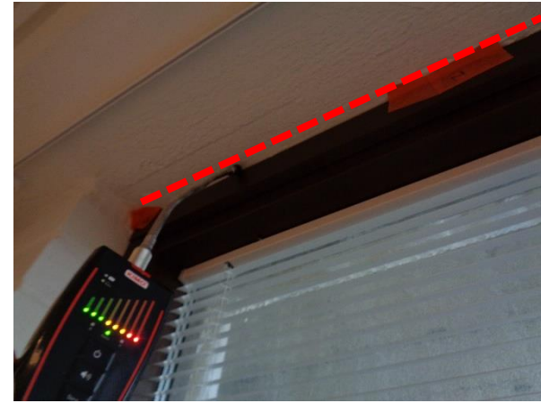
3. Alipaineistetuissa olosuhteissa yläkarmin ilmavuodot voimistuivat laaja-alaisiksi.
