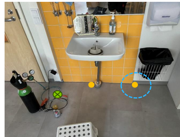
9. Alapohjan merkkiainekokeessa havaittiin vähäistä (pistemäinen) ilmavuotoa pesualtaan viemäriputken läpiviennistä. Alipaineistettuna havaittiin lisäksi vähäistä pistemäistä vuotoa väliseinäliittymästä jalkalistan takaa.
