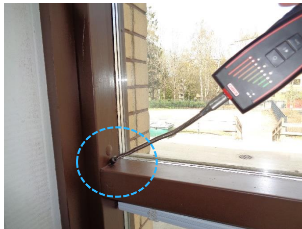
8. Oikeanpuoleisen ikkunan karmiliitoksesta todettiin merkittävää ilmavuotoa tilan ollessa alipaineistettuna.
