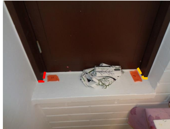
2. Vasemmanpuoleisen tuuletusikkunan karmien ja ikkunapenkin/ulkoseinän liittymistä todettiin osin merkittävää ja osin vähäistä rakomaista ilmavuotoa.
