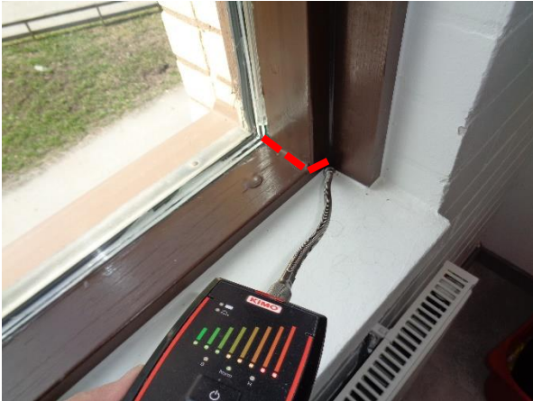
4. Ikkunan karmiliitoksesta todettiin merkittävää rakomaista ilmavuotoa tilan normaaleissa käyttöolosuhteissa.
