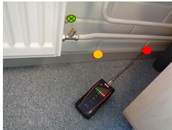
5. Ulkoseinän tiilisaumoista todettiin paikoin merkittävää tai pistemäistä ilmavuotoa lattialistan alta.
