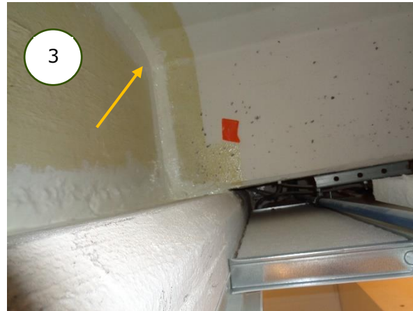
8. Tilan ollessa alipaineistettuna havaittiin alakattotilassa pistemäinen ilmavuotokohta lännenpuoleisen ulkoseinän ja välipohjan liittymässä.
