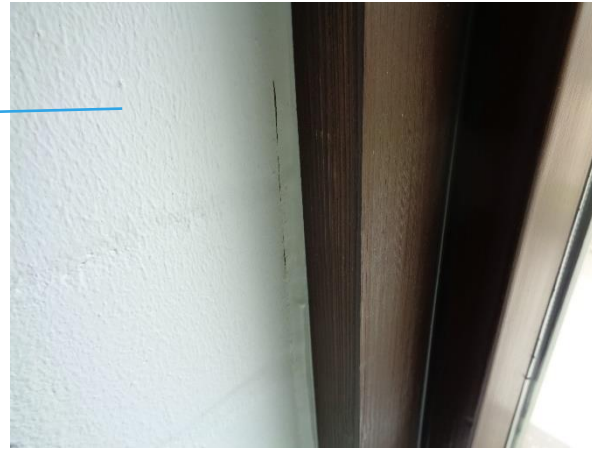
2. Karmin ja ikkunan liittymässä on aistinvaraisesti havaittavissa rakoilua.
