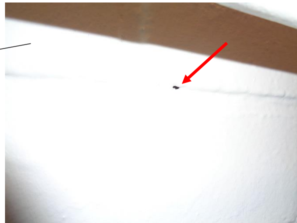
5. Tiilisaumassa on silmin havaittava rako.
