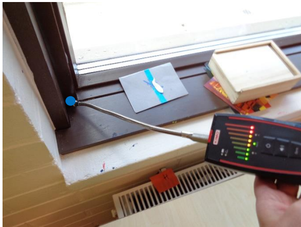
4. Ikkunan karmiliitoksesta todettiin pistemäistä ilmavuotoa molemmin puolin ikkunaa.
