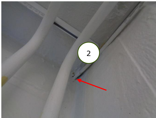
4. Sähköläpiviennistä todettiin merkittävää ilmavuotoa läntisellä ulkoseinälinjalla.
