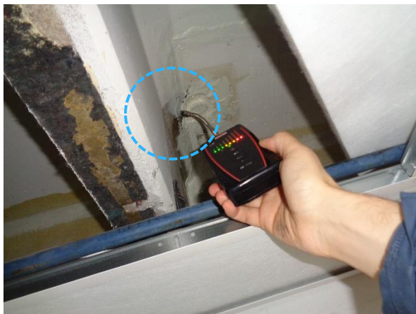
7. Välipohjan tiivistetystä läpiviennistä todettiin pistemäistä ilmavuotoa tilan ollessa alipaineistettuna.
