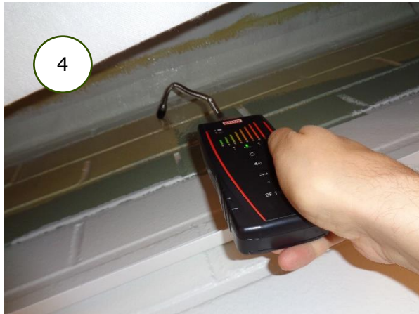
7. Alakattotilassa havaittiin paikoin merkittävää vuotoa ulkoseinän tiilisauoista (pohjoinen ulkoseinälinja).
