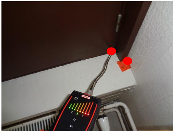
4. Ulkoseinän ja tuuletusikkunan karmin välisestä liittymästä todettiin merkittävää ilmavuotoa.
