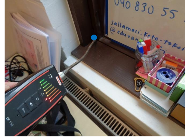
3. Ikkunan karmiliitoksesta havaittiin pistemäinen vuoto normaaleissa käyttöolosuhteissa.
