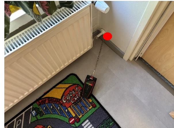
6. Tilan ollessa alipaineistettuna havaittiin merkittävää ilmavuotoa alapohjan ja väliseinän nurkalliittymästä.
