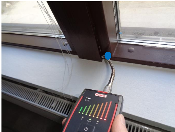
4. Ikkunakarmin ja ikkunapenkin liittymästä todettiin pistemäinen vuotokohta.
