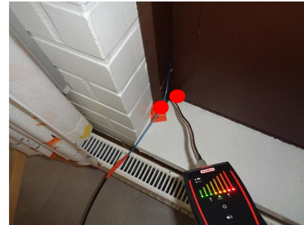
3. Ulkoseinän ja tuuletusikkunan karmin välisestä liittymästä todettiin merkittävää ilmavuotoa sekä ulkoseinän että alapohjan merkkiainekokeessa (ilmayhteys).
