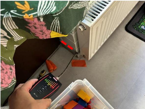
4. Alapohjan merkkiainekokeessa havaittiin merkittävää rakomaista ilmavuotoa lattialistan alta ulko-oven vierisestä alapohja-ulkoseinäliittymästä.
