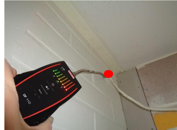
6. Alakattotilassa olevasta ulkoseinän tiivistetystä sähköläpiviennistä todettiin merkittävää ilmavuotoa huonetilan ollessa alipaineistettuna.
