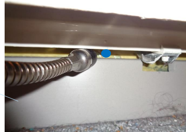
3. Patterinkannakkeen kohdalla lattialistan yläreunaa on leikattu. Vuotokohta saattaa mahdollisesti olla myös tiilisaumassa.
