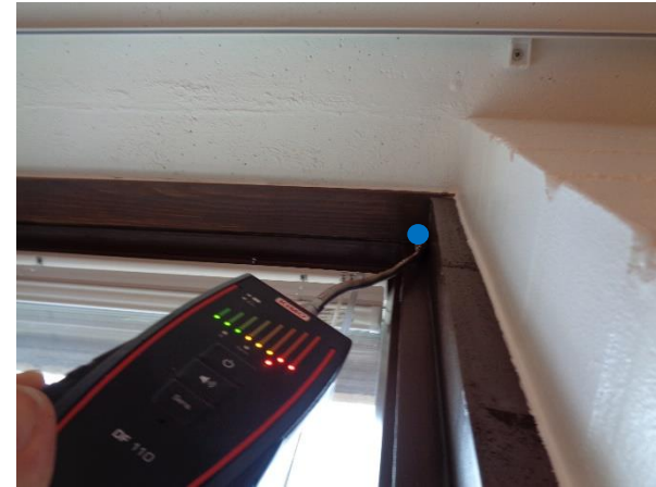
3. Ikkunan yläosan karmiliitoksesta todettiin pistemäistä ilmavuotoa molemmin puolin ikkunaa.
