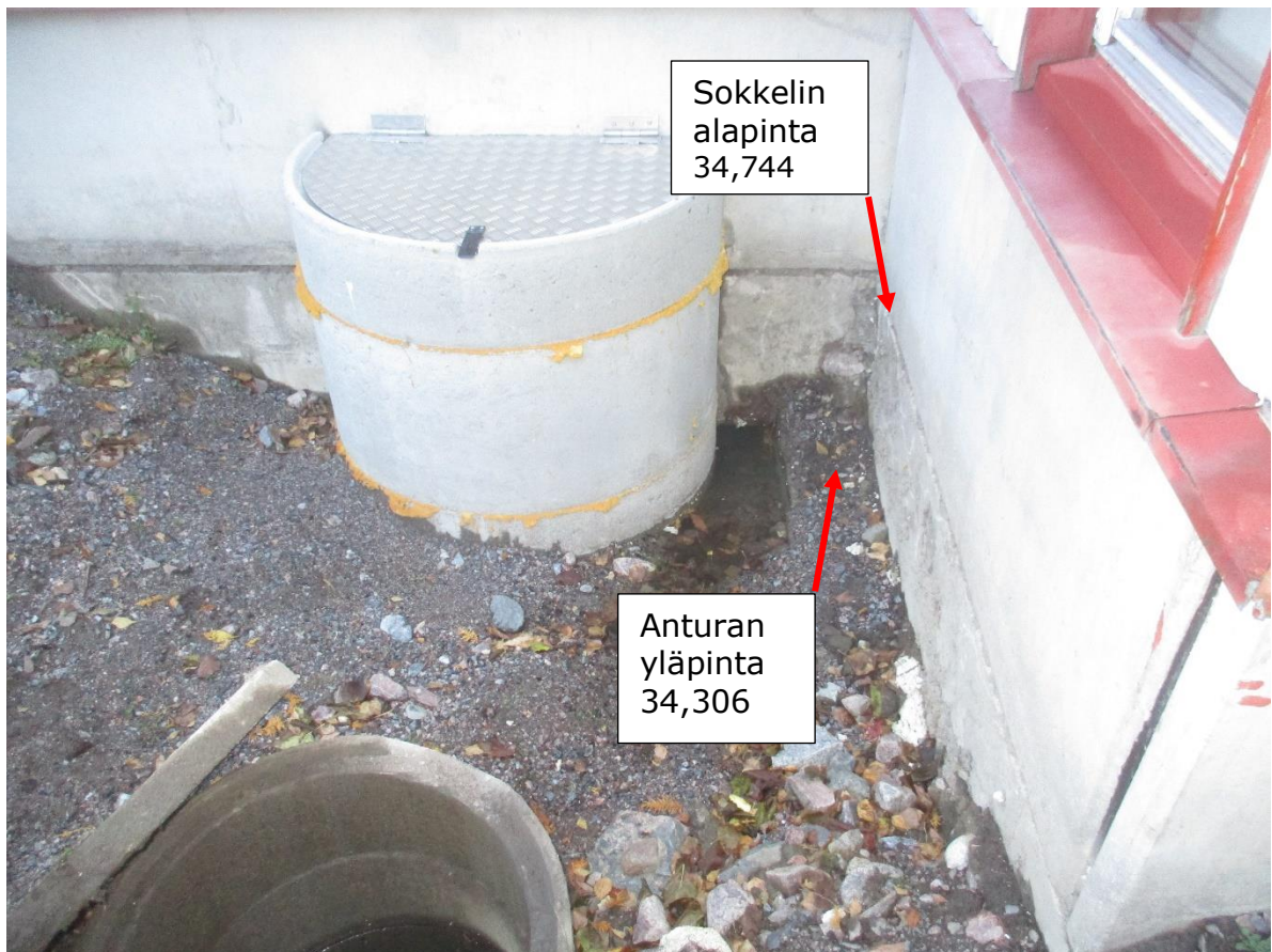
Kuva 4.3.1 Rakennuksen ryömintätilaan on tehty kulku. Tutkimushetkellä kulku oli täynnä vettä.
