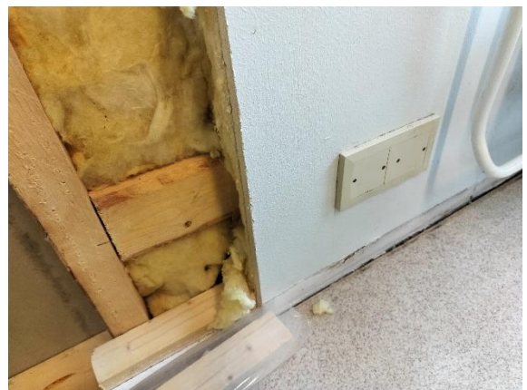
Kuva 6.2.4 Höyrynsulkua ei ole tiivistetty sähköputkien ympäriltä (RA.05)
