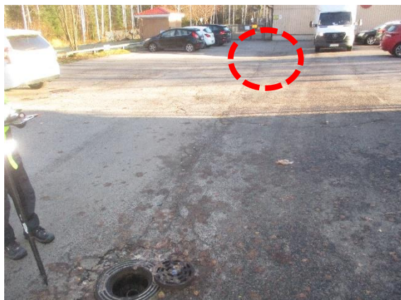
Kuva 4.3.2 Päiväkodin parkkipaikalla on sadvesikaivo, jota ei ole esitetty ulkojohtojen asemapiirrustuksessa.
