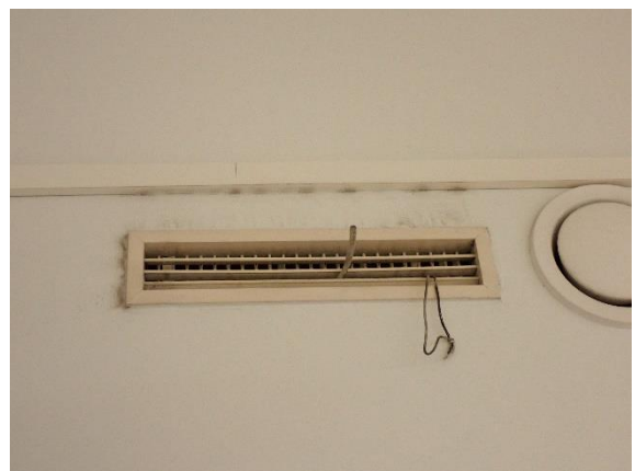
Kuva 8.2.10 Tuloilmasäleikköjen ja poistoilman päätelaitteiden sijoittelut huonetiloissa ovat pääasiassa vierekkäin samalle seinälle
