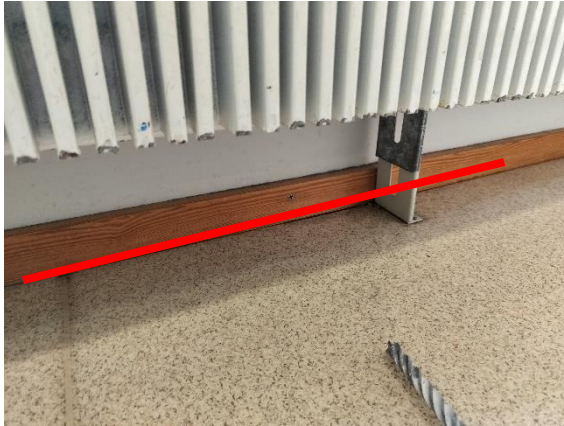
Kuva 5.4.1 Ilmavuotoreitti alapohja-ulkoseinäliittymässä tilassa 16
