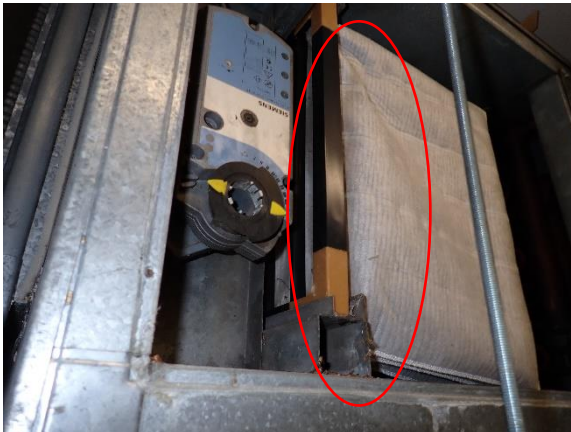
Kuva 8.2.3. Tuloilmasuodattimen ja huoltoluukun välinen tiiveys on puutteellinen
