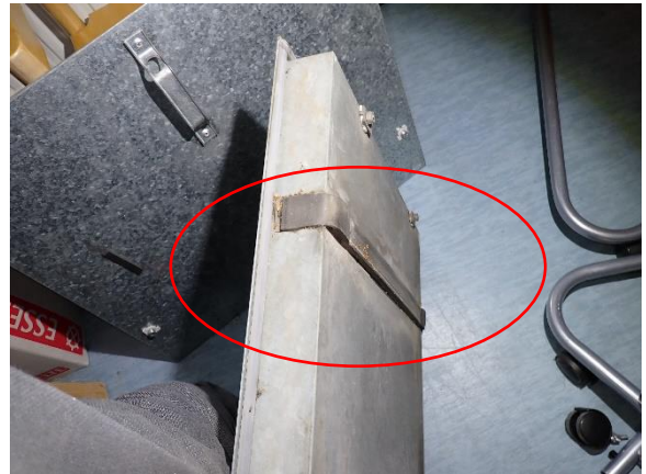
Kuva 8.2.4. Huoltoluukun tiivisteessä merkkejä ohivuodosta
