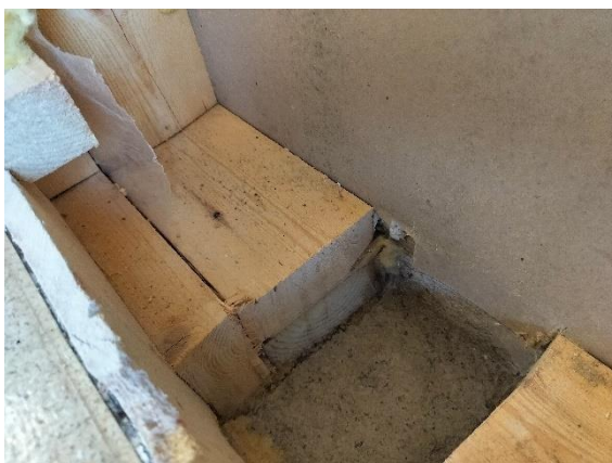
Kuva 6.2.5 Sokkelin alapinta on n. 150...200 mm lattiapinnan alapuolella
