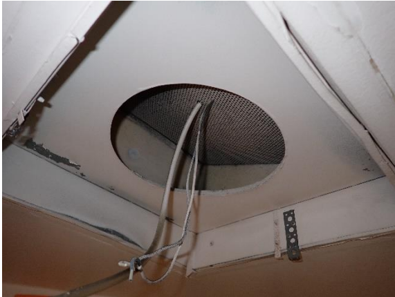
Kuva 8.2.7. Tuloilman päätelaitteista kattohajottajissa on niiden tasauslaatikoiden sisällä äänenvaimennusmateriaalia
