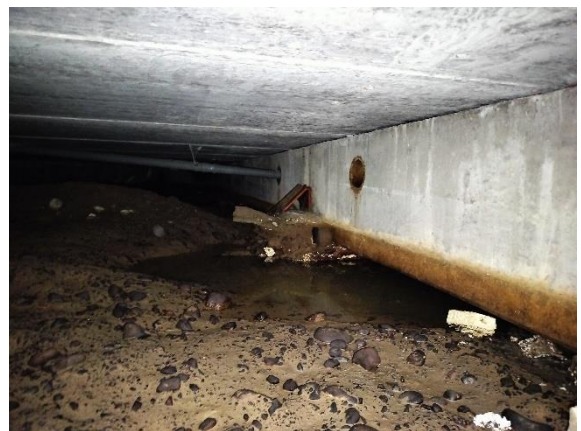
Kuva 5.2.4 Ryömintätilassa runsaasti vettä
