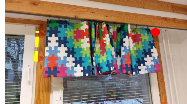
3. Ikkunan yläosassa havaittiin pistemäistä tai rakomaista ilmavuotoa.
