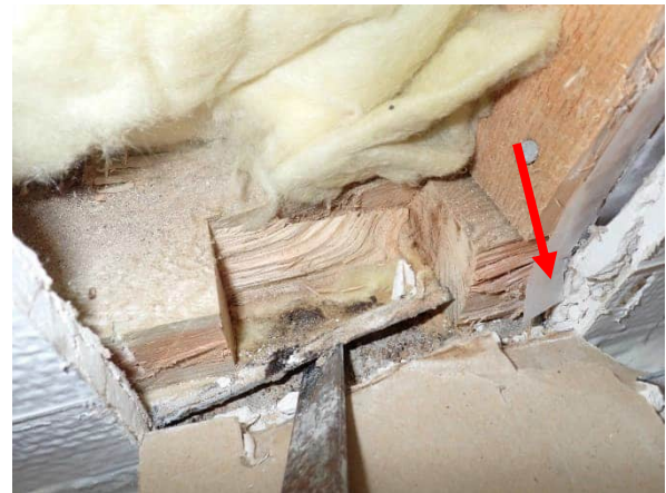
Ulkoseinärakenteen ja betonirakenteisen sokkelin väliin on asennettu kosteussulkuksi bitumikermi. Höyrynsulkumuovin alareuna on tiivistämättä.
