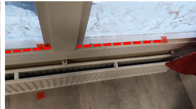
6. Oikeanpuoleisesta ikkunaliittymästä todettiin merkittävää laaja-alaista ilmavuotoa alipaineistetuissa olosuhteissa.
