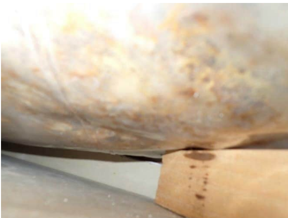
Eristekerroksen pohjalla havaittavissa todennäköisesti pieneläinten aiheuttamaa roskaamista tai jätöksiä.
