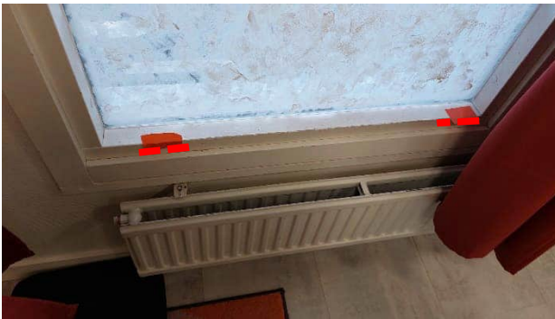
4. Vasemmanpuoleisesta ikkunaliittymästä todettiin merkittävää rakomaista ilmavuotoa alipaineistetuissa olosuhteissa.
