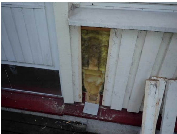
Yleiskuva näytteenottokohdasta. Tuulensuojavillan ulkopinnalla havaittiin voimakasta tummentumaa.
