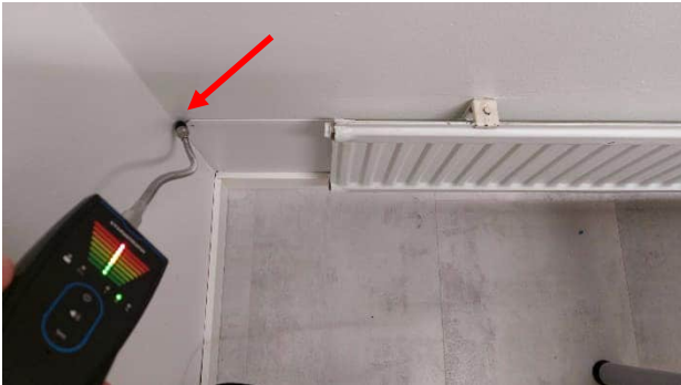
4. Ulkoseinään tehdyn rakenneavauksen kohdalta (peitelevyn alta) todettiin merkittävää rakomaista ilmavuotoa. Alapohjaliittymästä tai patterinkannakkeista ei havaittu vuotoja.
