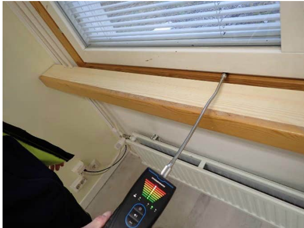
1. Vasemmanpuoleisesta ikkunaliittymästä todettiin kauttaaltaan merkittävää ilmavuotoa sekä normaaleissa käyttöolosuhteissa että alipaineistettuna.
