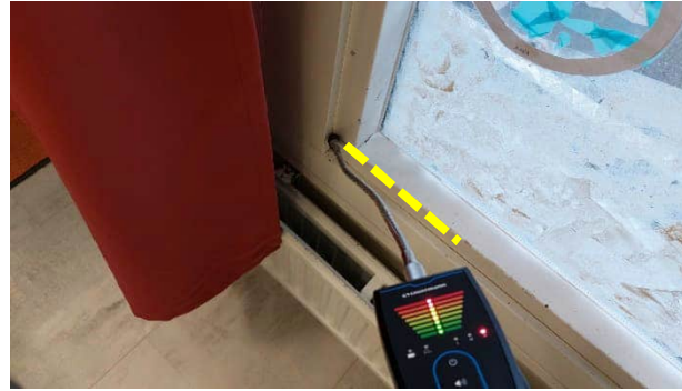
2. Keskimmäisen ikkunan nurkka-alueilla todettiin vähäistä rakomaista ilmavuotoa normaaleissa käyttöolosuhteissa.
