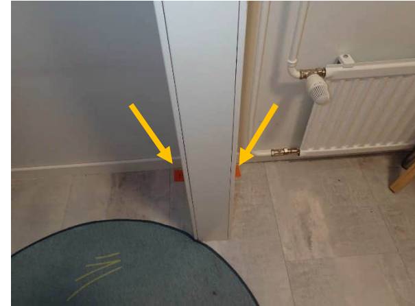
3. Ulkoseinän ja alapohjan liittymästä todettiin vähäistä pistemäistä ilmavuotoa väliseinäliittymän kohdalla tilan normaaleissa käyttöolosuhteissa.
