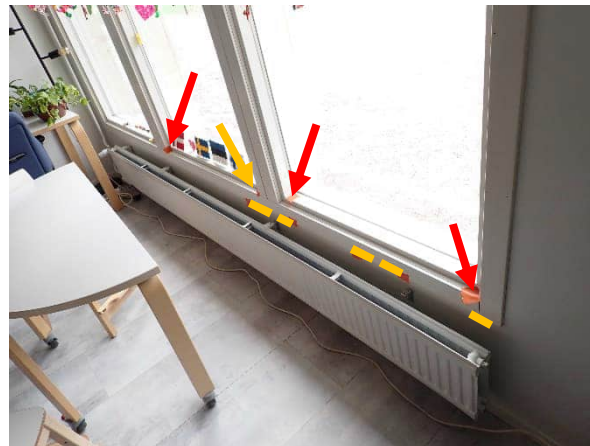
5. Tilan ollessa alipaineistettuna todettiin pistemäisten vuotojen lisäksi vähäistä rakomaista ilmavuotoa ikkunaliittymistä.
