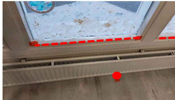
5. Keskimmäisesestä ikkunaliittymästä todettiin kauttaaltaan merkittävää ilmavuotoa alipaineistetuissa olosuhteissa. Ulkoseinän ja alapohjan liittymästä todettiin yksittäinen pistemäinen vuotokohta.
