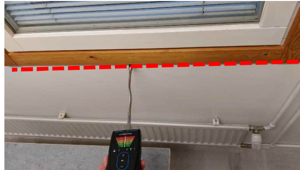
5. Ikkunan alareunasta todettiin merkittävää laaja-alaista ilmavuotoa.
