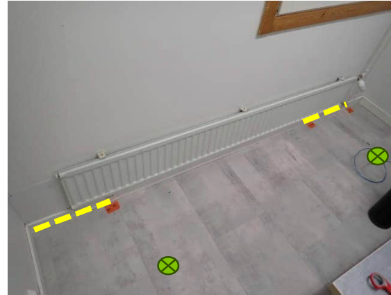
2. Alipaineistettaessa ilmavuodot alapohjan ja ulkoseinän liittymästä laajenivat jonkin verran.
