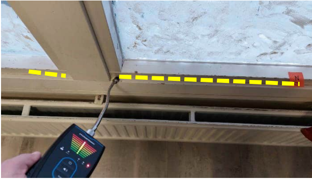
1. Oikeanpuoleisesta ikkunaliittymästä todettiin vähäistä laaja-alaista ilmavuotoa normaaleissa käyttöolosuhteissa.
