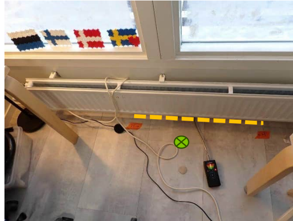
2. Alapohjan ja ulkoseinän liittymästä todettiin vähäistä laaja-alaista ilmavuotoa kaasunsyöttöpisteen kohdalla tilan normaaleissa käyttöolosuhteissa.
