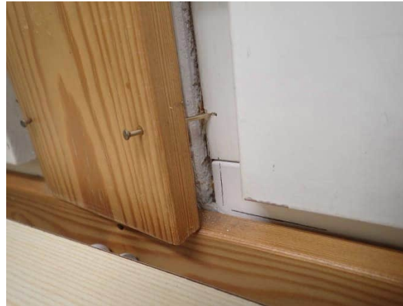
2. Ikkunoiden välissä oleva peitelauta oli alaosaan irti. Ikkunaliittymiä sen takana ei ole tiivistetty, ja liittymästä todettiin etenkin alipaineistuksessa laaja-alaista ilmavuotoa.
