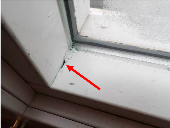
1. Oikeanpuoleisen ikkunan karmiliitoksessa havaittiin rako, jota on osittain tiivistetty. Kohdasta todettiin merkittävää pistemäistä ilmavuotoa normaaleissa käyttöolosuhteissa.
