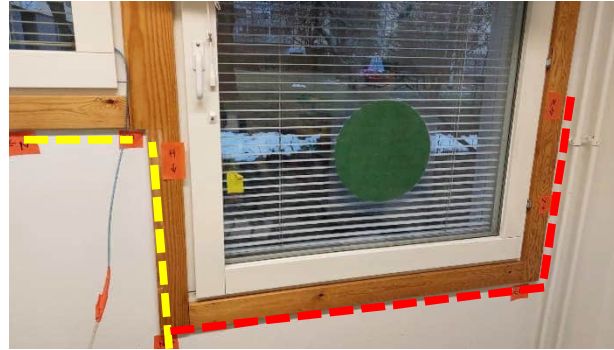
2. Ikkunaliittymistä todettiin merkittävää rakomaista tai laaja-alaista ilmavuotoa.
