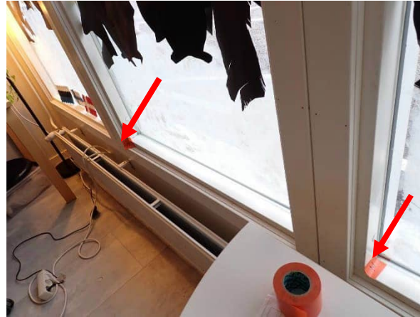
2. Ikkunoiden karmiliitoksista todettiin merkittävää pistemäistä ilmavuotoa tilan normaaleissa käyttöolosuhteissa.
