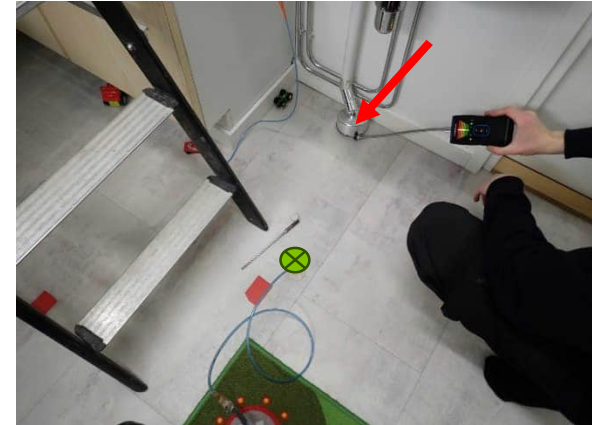
3. Vesipisteen putkiläpiviennistä todettiin merkittävää ilmavuotoa sekä normaaleissa käyttöolosuhteissa että tilan ollessa alipaineistettuna.
