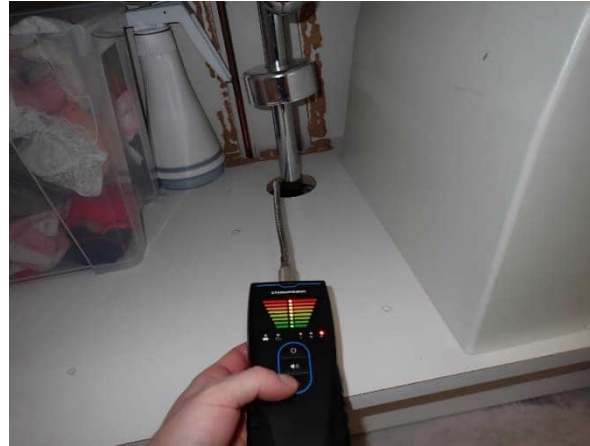
2. Vesipisteen putkiläpiviennistä todettiin merkittävää ilmavuotoa sekä normaaleissa käyttöolosuhteissa että tilan ollessa alipaineistettuna.
