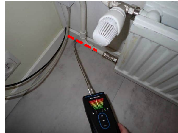
4. Ulkoseinän ja alapohjan välisestä liittymästä todettiin merkittävää rakomaista ilmavuotoa sekä normaaleissa käyttöolosuhteissa että alipaineistettuna.
