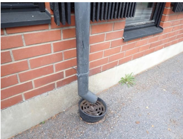
Avauskohdassa julkisivun puolella syöksytorstesta purkautuvat kattovedet ovat aiheuttaneet hieman kosteusjälkeä sokkelin pintaan.
