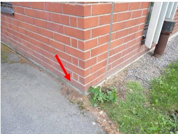
Rakenneavauksen kohdalla sokkelirakenne on erittäin matala ja siten alttiina ulkopuoliselle kosteusrasitukselle.
