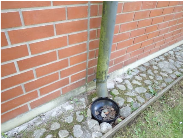
Rakenneavauksen kohdalla sokkelirakenteen pinnalla julkisivun puolella on kosteusjälkiä seurauksena syöksytorvesta valuvista vesistä.
