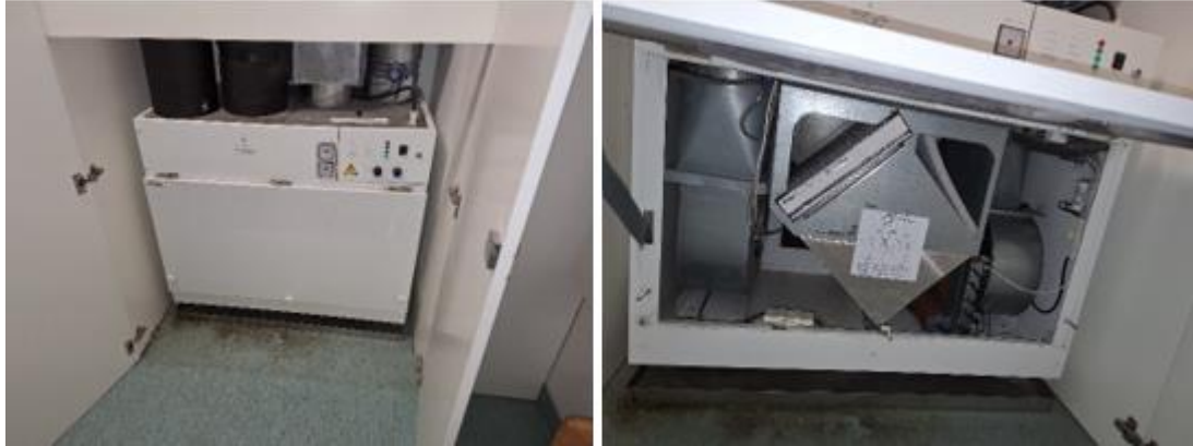
Kuva 55. Yleiskuvat ilmanvaihtokoneesta TK/PK15 (TK/PK12, TK/PK13, TK/PK16 ja TK/PK17 ovat samanlaisia). Ilmanvaihtokoneet ovat silmämääräisen arvion perusteella toimintakuntoisia.
