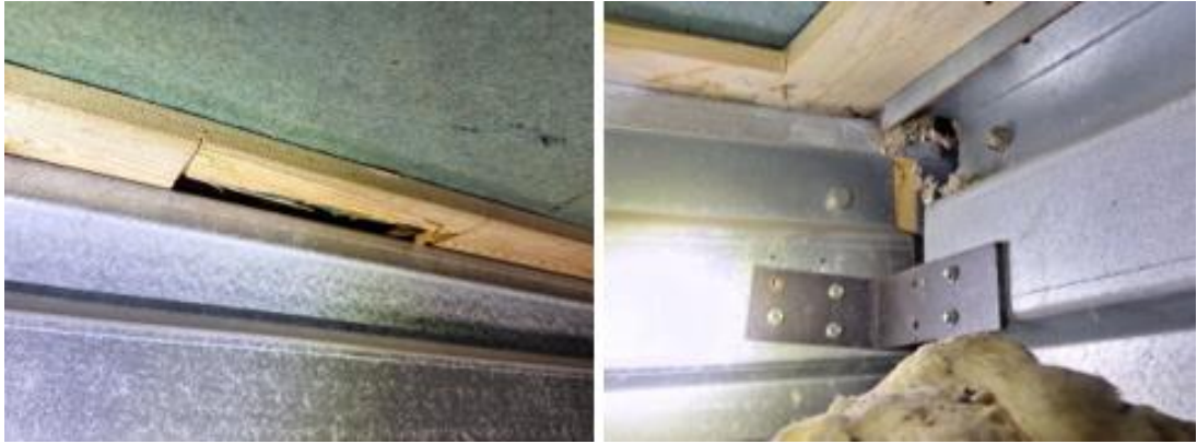
Kuva 23. Alapohjassa havaittiin joitakin hiirien kulkureittejä tilaelementtien saumojen kohdilla.
