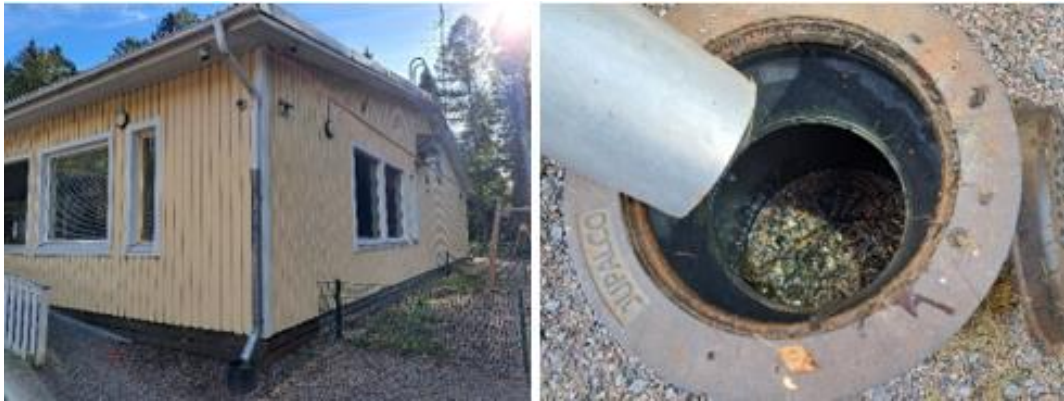
Kuva 4. Rakennuksen syöksytoria on uusittu aiemmin sinkityillä peltiputkilla, joita on jatkettu lisäpalalla lähemmäs sadevesikaivoja (vasen, kuva luoteisnurkasta). Lounais- ja luoteisnurkan kaivoissa on paljon hiekkaa pohjalla (oikea, kuva lounaisnurkalta).
