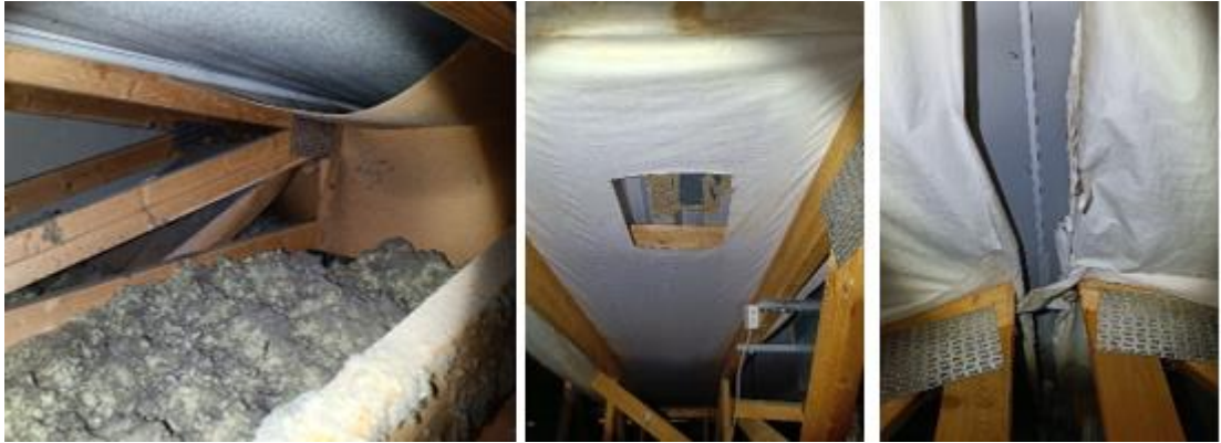
Kuva 44. Vasen kuva: Tuulenojaimet on tehty kovalevystä ja osa niistä on romahtanut. Keskimmäinen kuva: Aluskatteessa on muutamia epätiiviyiskohtia vanhan läpiviennin kohdalla ja joitakin nykyisistä läpivienneistä ei ole liitetty aluskatteeseen. Oikea kuva: Aluskatetta ei ole liitetty yhteen harjan kohdalla.
