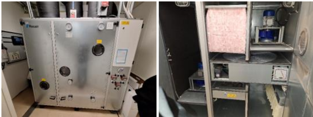
Kuva 56. Yleiskuvat ilmanvaihtokoneesta TK/PK01. Silmämääräisen arvion perusteella ilmanvaihtokone on hyvässä kunnossa.
