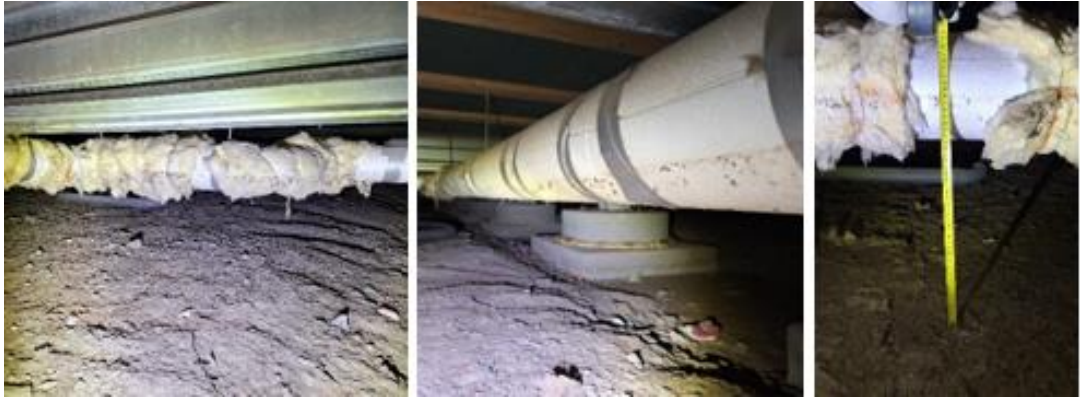
Kuva 21. Ryömintätilassa on kauttaaltaan putkien eristepinnassa havaittavissa vesirajan jälki noin 400 mm korkeudessa. Tilaan on siis päässyt joskus suuria määriä vesiä, ja vedenpinta on noussut puoleenväliin asti tilan koko korkeudesta. Putket on lämmöneristetty vaihtelevasti EPS-eristeellä ja mineraalivillalla.
