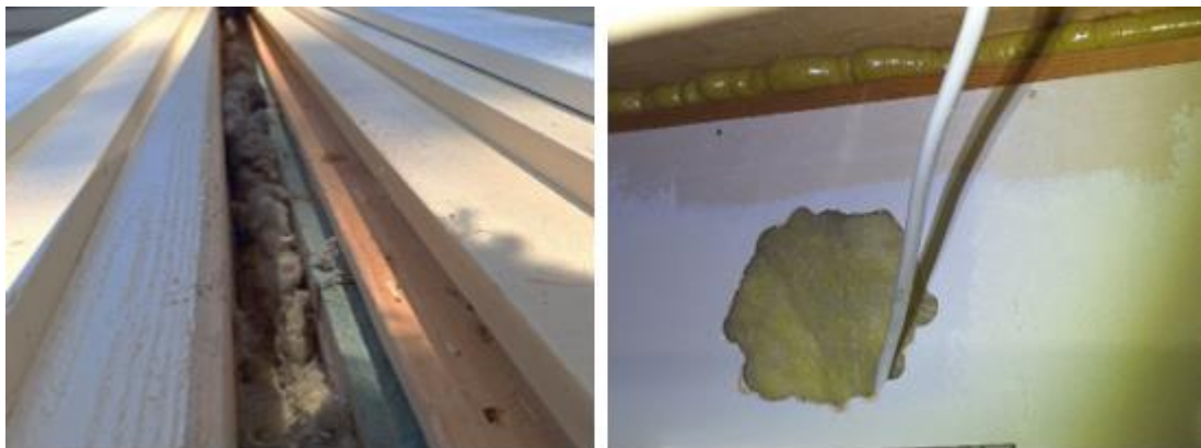
Kuva 31. Vasen kuva: Rakenneavaus RA23 rakennuksen pohjoissivulla tilaelementtien välisen sauman kohdalla. Sauman kohdalla seinässä ei ole tuulensuojalevyä. Oikea kuva: Rakennuksen idänpuolisella ulkoseinällä tilaelementtien sauman lähellä havaittiin hiiren kulkureitti ulkoseinän sisäpuolisen levytyksen läpi alakattotilaan. Kohdassa on ollut sähköläpivienti, jota jyrsijät ovat suurentaneet. Hiiret pääsevät kohtaan ulkopuolelta mahdollisesti elementtien sauman kautta.
