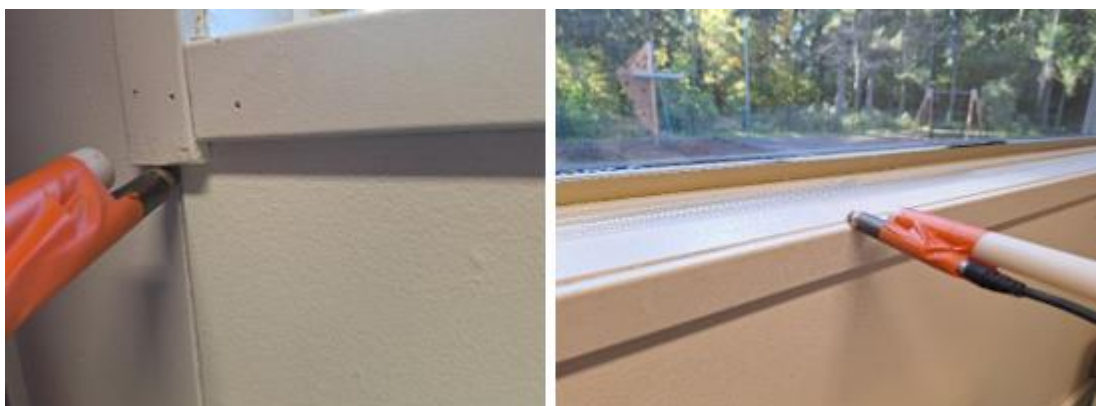
Kuva 35. Vähäistä pistemäistä ilmavuotoa havaittiin ikkunan liitoksista.
