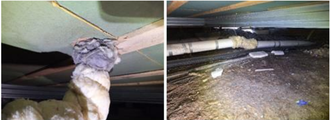
Kuva 24. Vasen kuva: Tuulensuojalevyssä havaittiin vuotojälki olotilan 21 käsienpesualtaan poistoputken ympärillä, jonka vieressä lauta oli piikkimittarilla 18,1...19,6 paino-%. Oikea kuva: Putki on takakaatonen juuri ennen runkoviemärilinjan purkua rakennuksen koillisnurkan alueella. Kohdassa kannake on vääntynyt. Putket heiluvat yleisesti ryömintätilassa ja sivusuuntainen kannakointi on puutteellinen.
