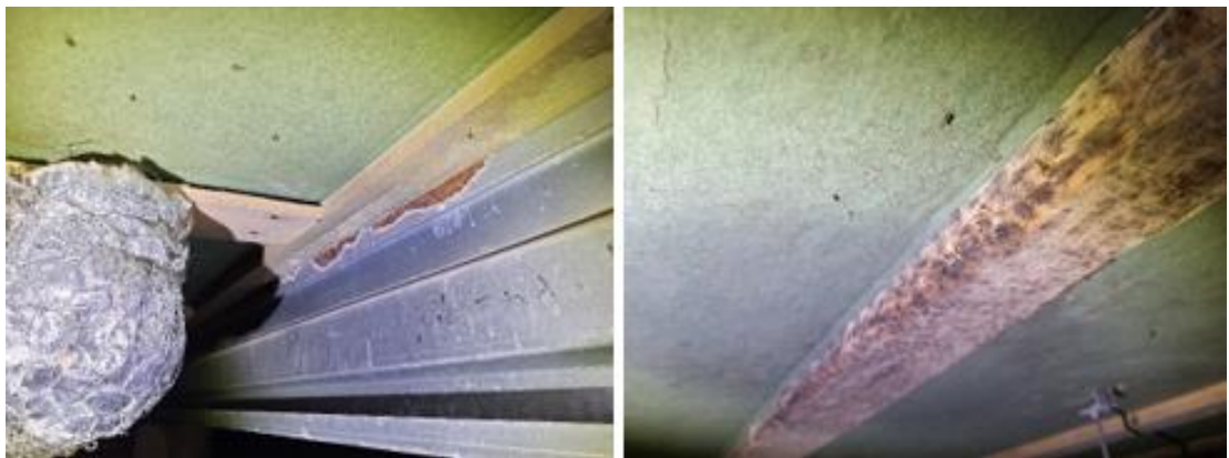
Kuva 20. Tuulensuojalevyssä on laaja-alainen kosteusjälki olotilan 22 toisen tilaelementin kohdalla. Sigma-palkissa on kohdassa ruostejälki. Tuulensuojalevyn harvalaudoituksessa on kohdassa merkittävää tummaa pilkkuilua (piikkimittarilla 22,3 paino-%). Puukoolingeissa on vaihtelevasti ryömintätilassa pilkkuilua myös muualla. Joidenkin tilaelementtien alueella oli pilkkuilevia ja täysin puhtaita laudoituksia. Laidoituksista mitattiin kosteuspitoisuutta piikkimittarilla eri puolilta ryömintätilaa ja niiden kosteus vaihteli välillä 19,4...24,2 paino-%.
