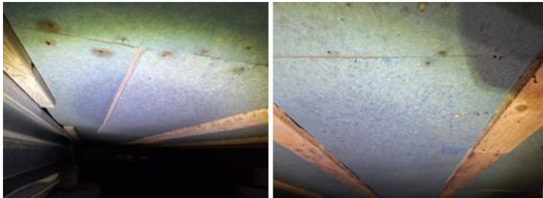
Kuva 18. Tuulensuojalevyjen kiinnitysnauloissa on ruostejälkiä alueittain ryömintätilassa. Tuulensuojalevyjen saumoja ei ole tiivistetty teippauksin. Tuulensuojalevyjen pinnassa on tummaa pilkkuilua joillakin alueilla ja sigmapalkin pinnassa on ruostekohtia paikoitellen.
