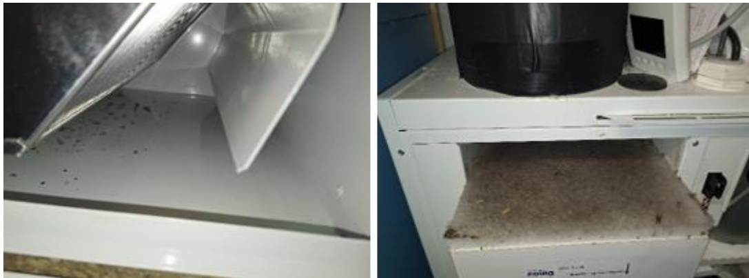
Kuva 60. Yleiskuvat ilmanvaihtokoneiden puhtaudesta. Huonetilojen "asuntokohtaisten" iv-koneiden suodattimien havaittiin olevan likaiset ja koneiden pohjalla olevan runsaasti hyönteisiä.
