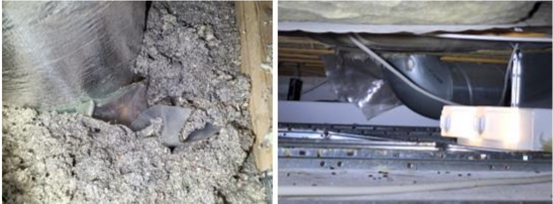
Kuva 46. Yläpohjan höyrynsulku on osan läpivientien kohdalla epätiivis.
