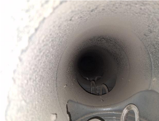
Kuva 59. Yleiskuva poistoilmanvaihtokanavistosta. Kanavistossa havaittiin runsaasti pölynkertymää.
