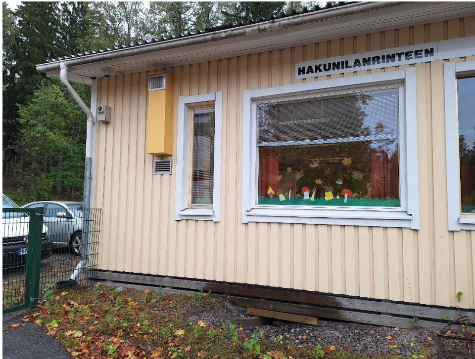
Kuva 42. Rakennuksen pohjoissivulla koillisnurkan vieressä vesikaton räystäskourun laidan yli vuotaa sadevesiä.
