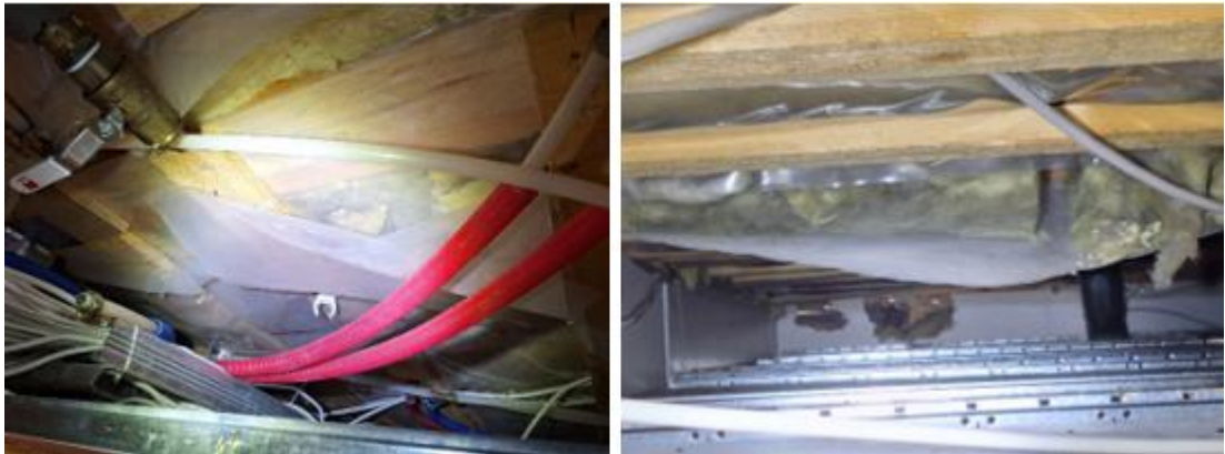
Kuva 47. Yläpohjan höyrynsulku on useissa kohdissa epätiivis.
