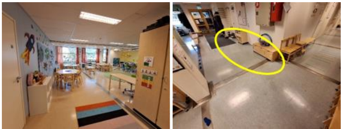
Kuva 7. Yleiskuvia alapohjasta olotilassa 18 (vasen) ja aulassa 26 (oikea). Aulan 26 kuvassa näkyvien ovien edessä on tilaajalta saatujen tietojen perusteella ollut aiemmin katon vesivuoto.
