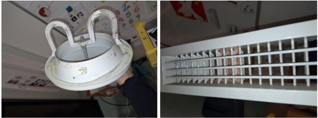
Kuva 57. Yleiskuvat poistoilmapäätelaitteesta (vasemmanpuoleinen kuva) ja tuloilmapäätelaitteesta (oikeanpuoleinen kuva). Päätelaitteissa havaittiin jonkin verran pölynkertymää.
