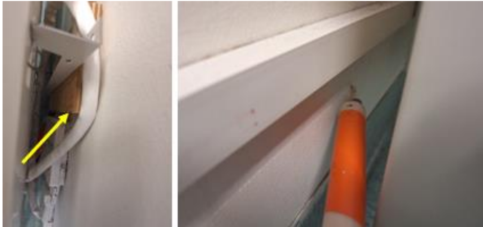
Kuva 34. Vähäistä pistemäistä ilmavuotoa havaittiin patterikannakkeiden kiinnikekohdista sekä vanhoista kiinnikereijistä seinän levytyksessä.
