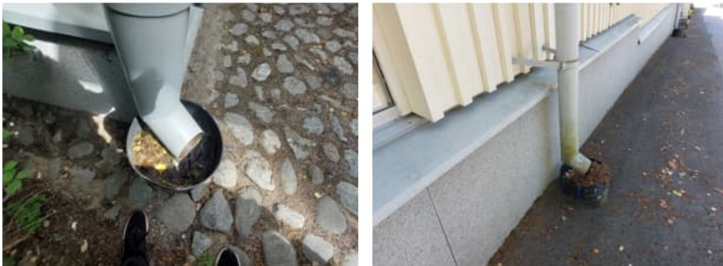
Kuva 9. Sokkelinvierustalla on pääosin betonoitu sokkelikiveys. Kadun puolella on hyväkuntoinen asfaltti. Rännikaivot olivat monin paikoin tukossa.
