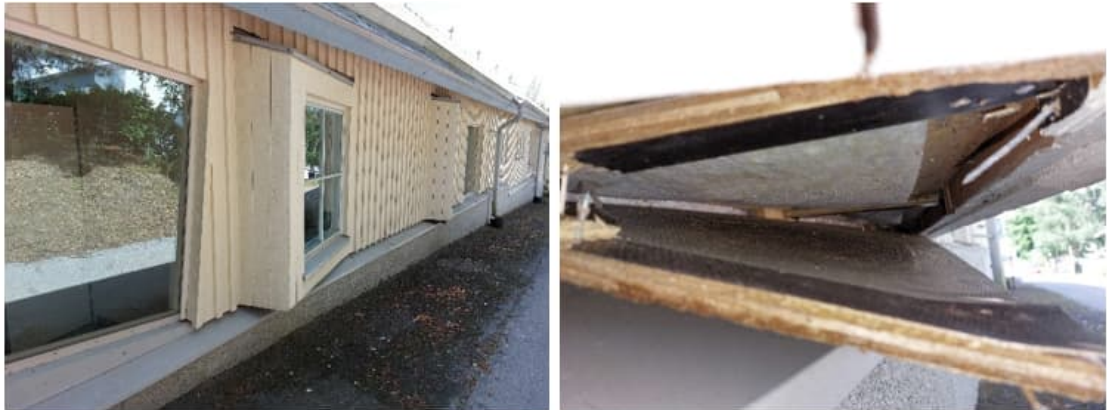
Kuva 34. Pohjoisjulkisivun ulokkeellisissa ikkunoissa on rakenteen alapinnassa vesivaneri, jonka takana on lämmöneriste. Eristeessä havaittiin eläinten jätöksiä.
