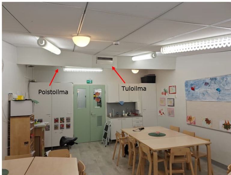
Kuva 74. Päiväkodin tyypillinen ilmanjakotapa. Esimerkkikuva tilasta Vaahteramäki (ryhmähuone 39).
