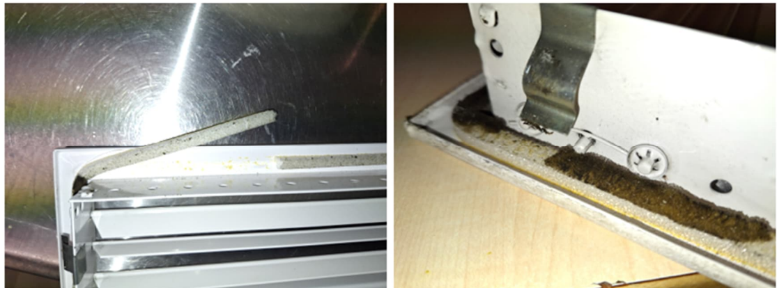
Kuva 71 a ja b. Tuloilmasäleikön tiivisteet ovat osin revenneet. Säleiköissä on myös mineraalivillaa.
