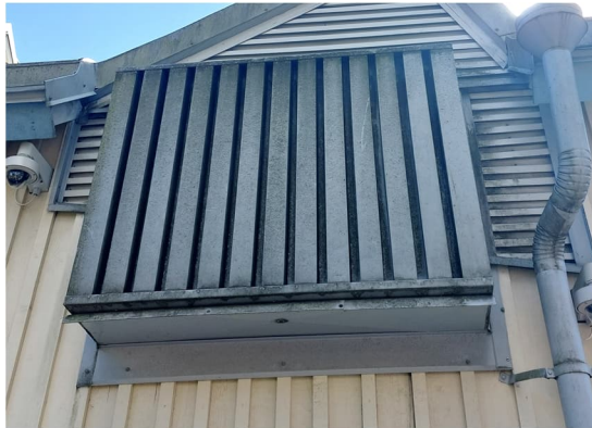
Kuva 57. Yleiskuva ilmanvaihtokoneen ulkoilmaottoaukosta. Ulkoilmanotto on varustettu lumisuojailla.
