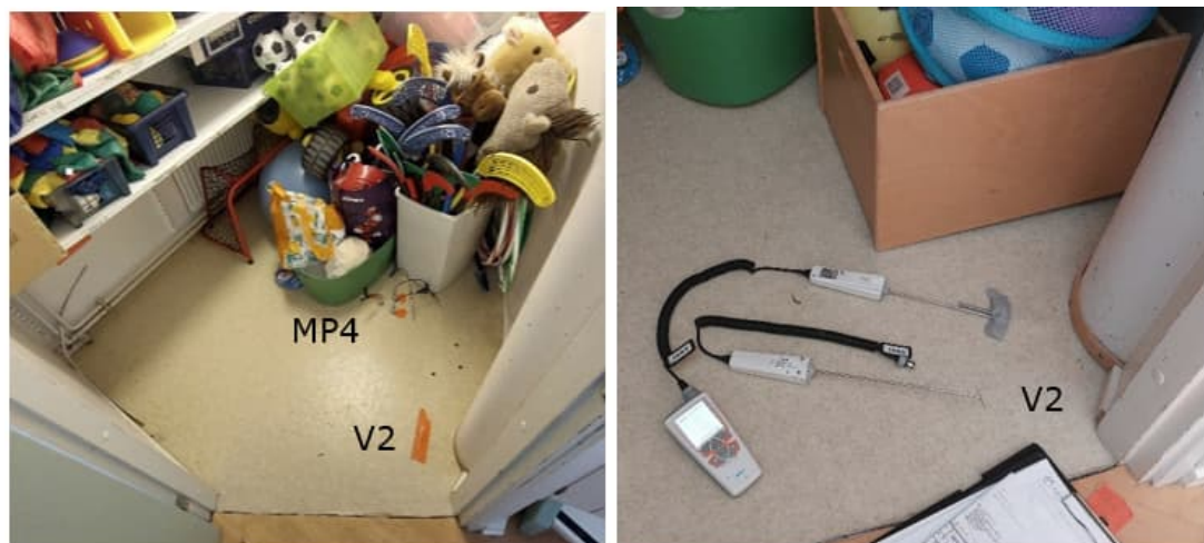
Kuva 17. Porareikämittapiste MP4, sekä oranssin teipin kohdalla viiltomittaus V2 (59,6 %RH). Muovimatto oli hyväkuntoinen ja tiukasti kiinni alustassa.
