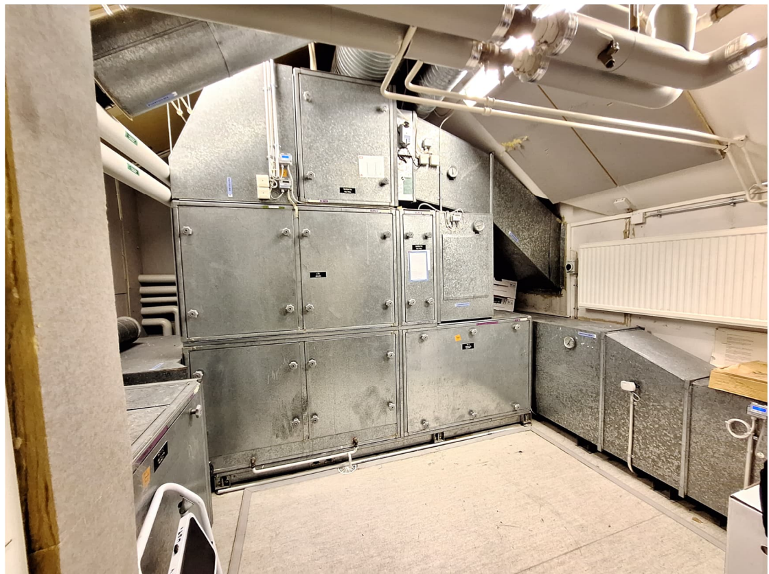
Kuva 56. Yleiskuva tulo-poistoilmanvaihtokoneesta TK1/PF1
