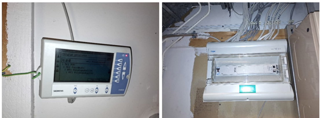
Kuva 67 IV-koneiden automaation käyttöpääte (vasemmalla) ja keskusyksikkö (oikealla).
