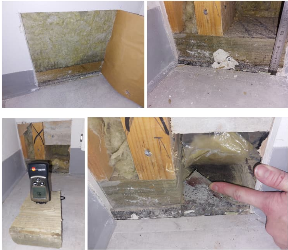
Kuva 32. Höyrynsulkupaperin alareuna ei liity tiiviisti alapohjaan ja lattianrajassa on rako. Alajuoksupuoli oli kuiva: kosteuspitoisuus piikkimittarilla mitaten 9,9 %. Alajuoksupuolelta ei havaittu merkkejä kosteusjäljestä. Kuvissa rakenneavaukset RA3 ja RA29.
