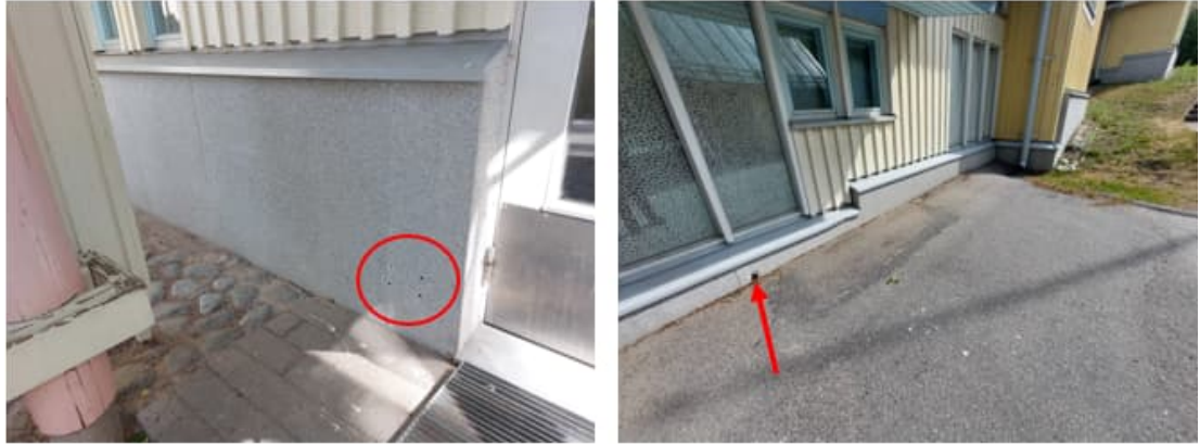
Kuva 25. Julkisivun sokkelilevytyksessä oli lohkeamia ja halkeamia.
