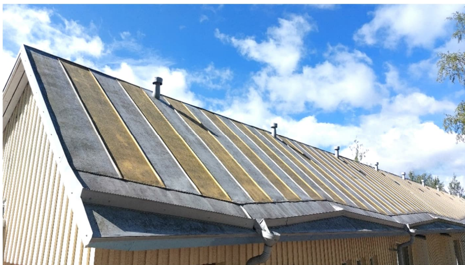
Kuva 41. Vesikaton pohjoisen puoleinen lape on likaantunut.
