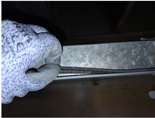
Kuva 58. Yleisesti ilmanvaihtokoneen runko-osissa havaittiin paikoin ilmavuotoja (saumakohdat, huoltoluukut, läpiviennit).
