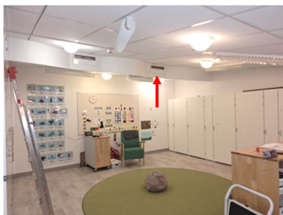
Kuva 73. Pihlajapolku (Lepo- ja leikkihuone 44). Oikeanpuoleinen tuloilmalaatikko on irti ja/tai huonosti kiinnitetty.
