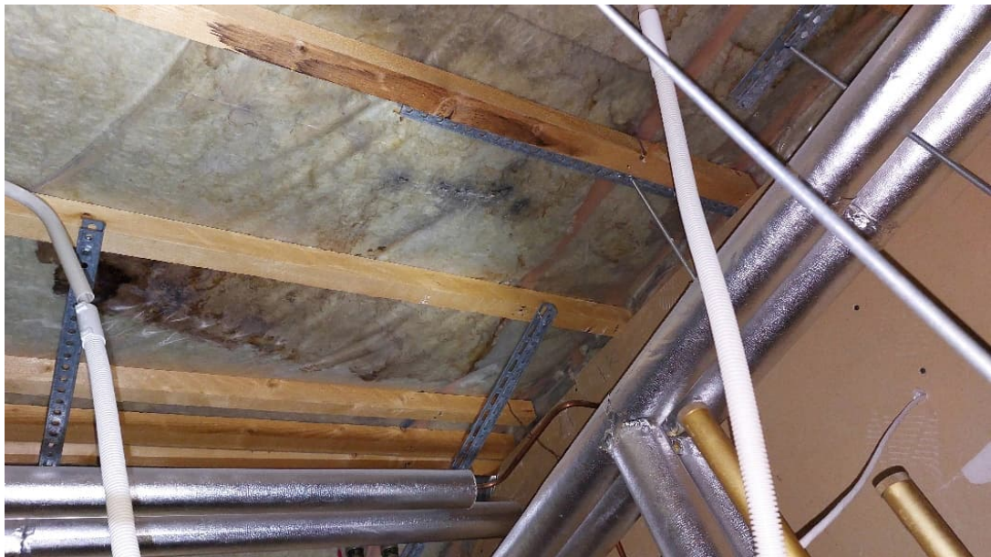
Kuva 45. Edellisen kuvan alapuolelta alakattotilasta kuvattuna vuotojälki, joka voi olla vanhan vesikaton ajalta tai jysijöiden aiheuttama. Kohdassa mineraalivillat haisivat ummehtuneilta. Jäljet ovat höyrynsulun yläpuolella.
