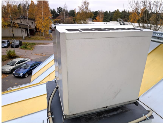
Kuva 65. Yleiskuva keittiön PF2 huippuimurista.
