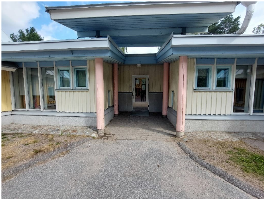
Kuva 11. Sisääntulokatoksen puiset kannatintolpat ovat paikoitellen halkeilleet. Vastaavanlaisia halkeamia oli myös keittiön sisääntulokatoksen kohdalla, ks. kuva 8.
