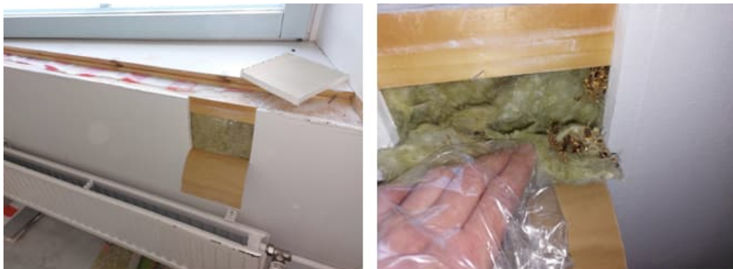
Kuva 33. Pohjoisjulkisivun ulokkeellisten ikkunoiden ja ulkoseinän liittymiä tarkasteltiin rakenneavauksista. Vainikkunan sisäverhouslevyn ja ikkunapenkin liittymä ei ollut tiivis. Ikkunapenkin höyrynsulkuna on rakennusmuovi, jota ei ole liitetty ulkoseinän höyrynsulkupaperiin.
