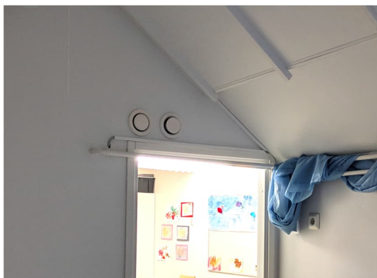
Kuva 72. Pienryhmätila 40, tuloilmapäätelaitteena on käytetty URH-poistoilmaventtiiliä.
