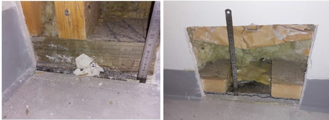
Kuva 21. Alapohjan ja ulkoseinän liitoskohdat eivät ole ilmatiiviitä. Alapohjan betonivalussa on halkeama.
