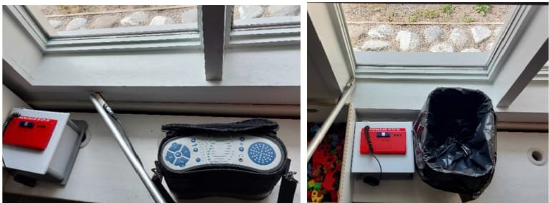
Kuva 23. Pistemäistä ilmavuotoa todettiin ikkunapenkin/ikkunakarmin alta sekä ikkunan karmiliitoksista.
