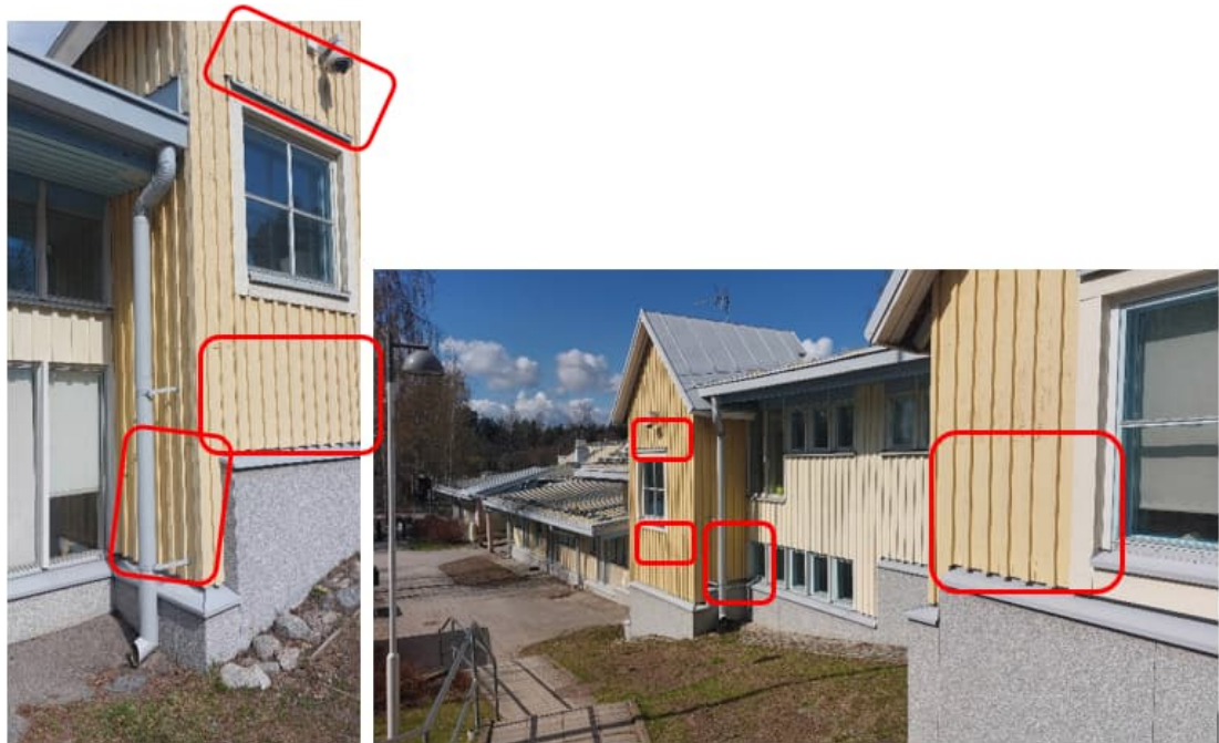
Kuva 30. Julkisivulaudoitusta on uusittu monin paikoin pihanpuoleisella eteläjulkisivulla. Kuvassa laudoitusta on uusittu punaisella ympyröidyissä kohdissa. Vastaavia laudoituksen uusimisia on tehty kaikkien eteläjulkisivun ulokkeellisten tilojen kohdalla.
