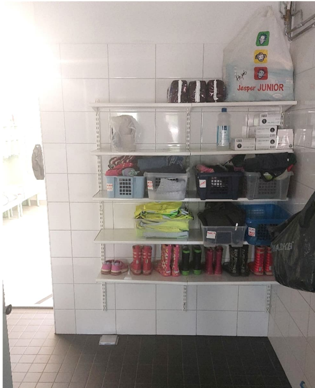
Kuva 35. Väliseinien keraamiset laattapinnat olivat hyväkuntoisia.
