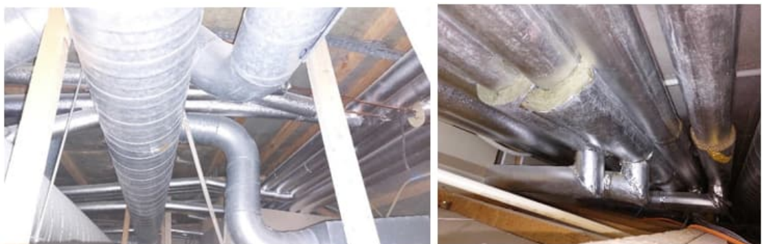
Kuva 53. Alakattotilassa oli jonkin verran pölyä sekä avoimia mineraalivillapintoja.
