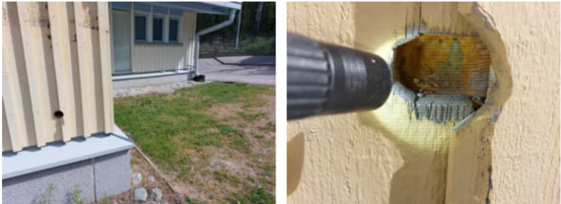
Kuva 26. Eskaripäädyn kotikeittiön ulkoseinän julkisivulaudoituksessa oli reikä, jonka tarkoitus ei selvinnyt.
