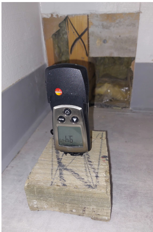
Kuva 31. Rakenneavaus RA3, ulkoseinän alaohjauspuun alapinta oli piikkimittarilla mitattuna kuiva (9,4 paino-%). Vastaavia lukemia saatiin myös ulkoseinän avauksesta RA29.
