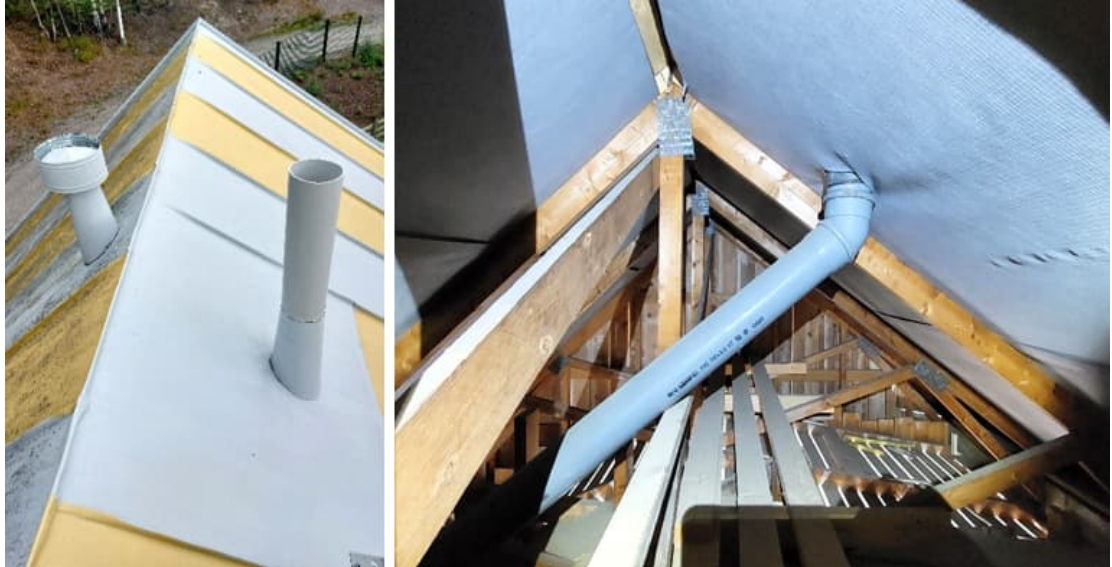
Kuva 44. Vesikaton läpivientejä: vasemmalla alipainetuuletin ja oikealla viemärin tuuletusputki, joka on liitetty aluskatteeseen tiivistä teippaamalla (kuva oikealla). Kohdassa ei havaittu vuotojälkiä yläpohjassa.
