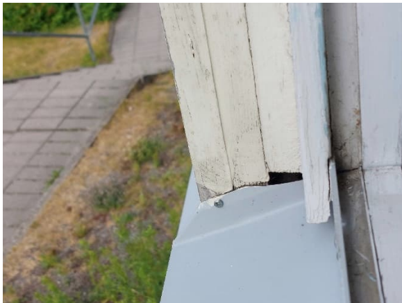
Kuva 27. Ikkunoiden vesipellityksissä havaittiin toistuvasti tiiveyspuutteita ulkoseinäliittymään. Sadevesi voi päästä ulkoseinärakenteen sisään.
