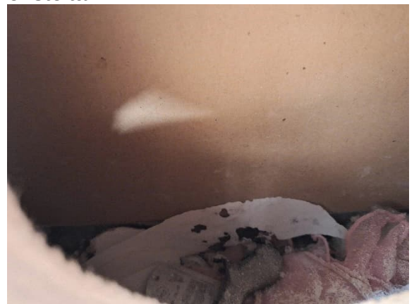
Kuva 83 VS3. Väliseinässä ei ollut eristeitä, mutta pohjalla oli paljon leluja ja paperista tavaraa. Paperiroskasta otettiin mikrobi-näyte.
