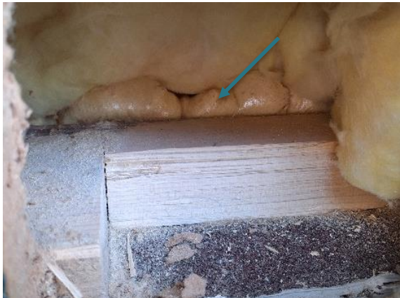
Kuva 45 US7, alaohjauspuun takana hieman polyuretaanivaahtoa.
