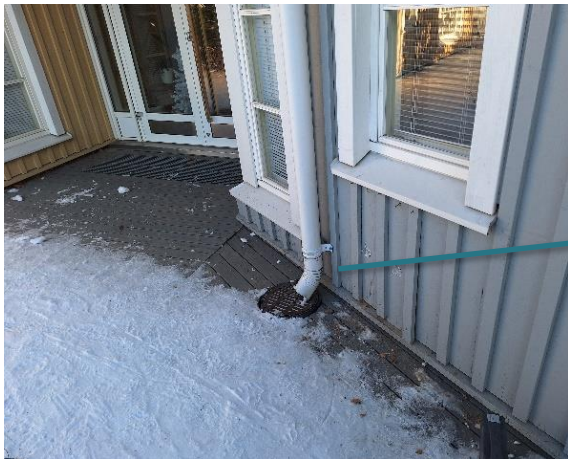
Kuva 41 US7 tilan 132 ikkunan alle.
