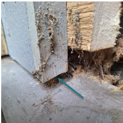
Kuva 67 US11. Lomalaudoituksen viisteet ovat vähäiset.
