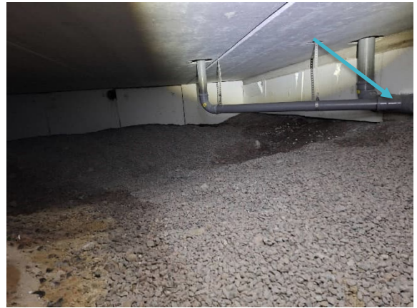
Kuva 19 Alapohjan viemärin oikeanpuoleisen ylösnousun haaroissa ei ole kannaketta.
