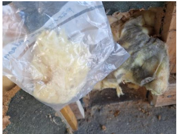
Kuva 36 US5, eristenäyte LN5 otettiin eristeen keskiosista, jossa ei ollut tummentumia. Eristeen alaosissa on tummentumaa.
