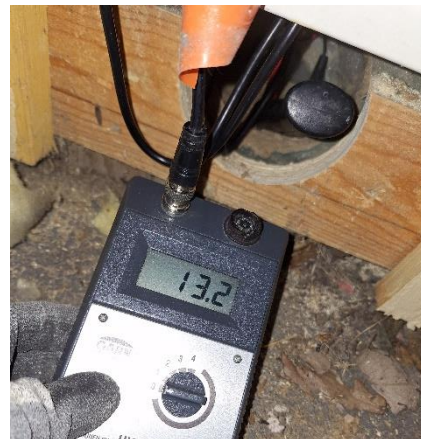
Kuva 10 US2. Avauksen alaohjauspuun kosteus on 13,2 p-%.
