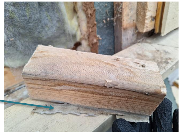
Kuva 20 US3B. Alaohjauspuun alareunassa on tiivistysmassaa. Puussa on valumajälkiä.
