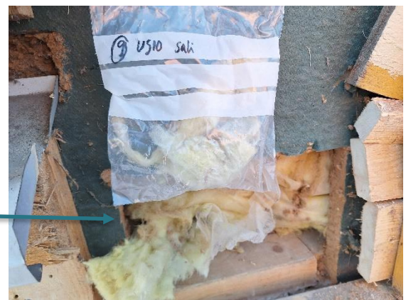
Kuva 58 US10, näyte LN9 otettiin eristevillasta alaohjauspuun päältä. Eristeessä ei ollut tummumia.
