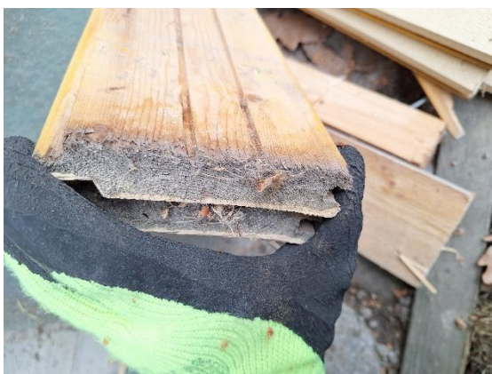
Kuva 21 US3B. Lomalaudoituksen alaosassa on tummumista. Alaosan viiste on pieni.
