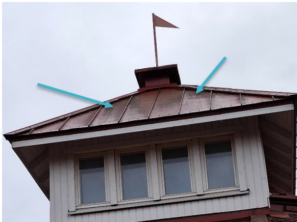
Kuva 100 Salin kohdalla on hieman leväkasvustoa.
