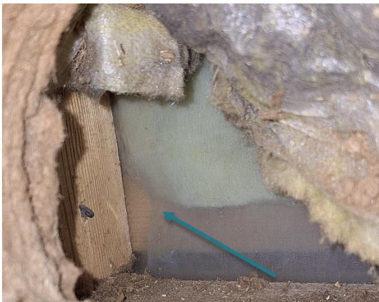
Kuva 9 US2. Höyrynsulun limitys avauskohdalla, limitystä ei ole teipattu. Muovi jatkuu alaohjauspuun taakse.
