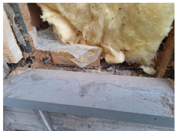
Kuva 70 US11. Lika pyyhitty vaakalaudoituksen päältä pois. Maalia ei ole yltänyt lautojen väliseen osaan.
