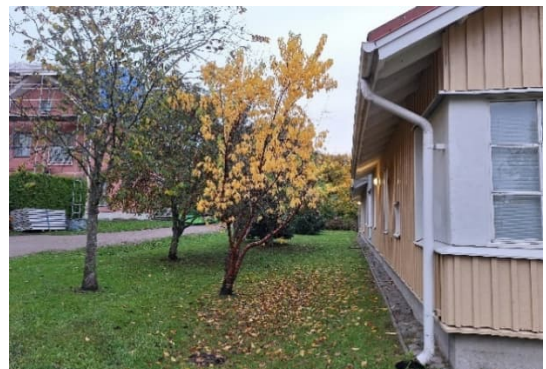
Kuva 11 Maanpinnan kaato on rakennuksesta pois päin. Lähin puu on pari metrin päässä rakennuksesta.
