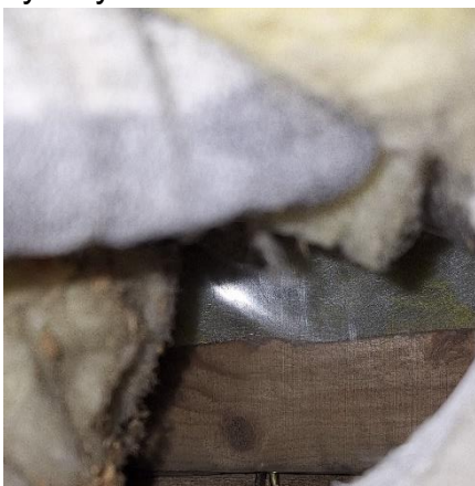
Kuva 3 US1. Mineraalivilla on kangaspäällysteinen. Eristeen takana on höyrynsulkumuovi. Eriste on alaosistaan tummunutta.
