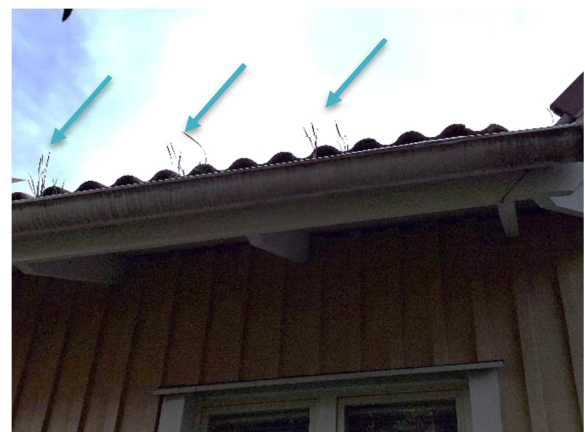
Kuva 105 Rännissä kasvaa heinää talon pohjoisivallalla.
