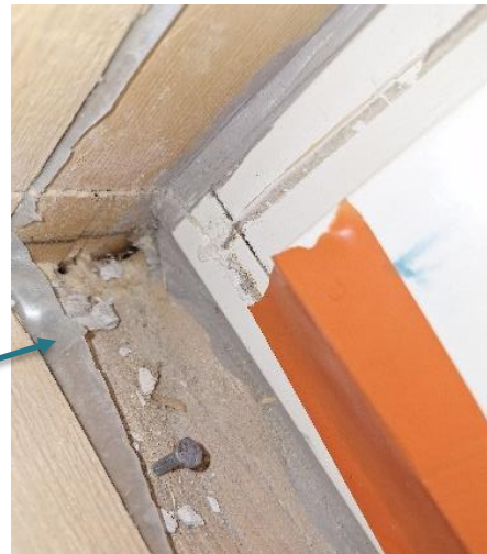
Kuva 82 US13. Ikkunan ympäri on vedetty harmaa tiivistysmassa. Läpinäkyvä muovi on puukoolausten välissä, teippaus puuttuu.
