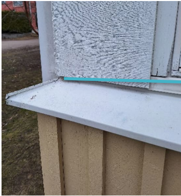
Kuva 40 Länsipäädyn ikkunarakenne ei ole tiivis.
