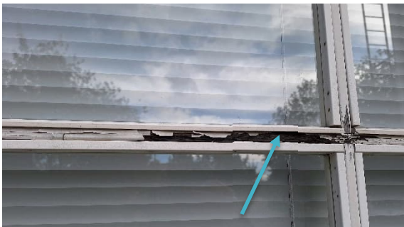
Kuva 42 Länsipäädyn ikkunassa on maali- ja lahovauriota.
