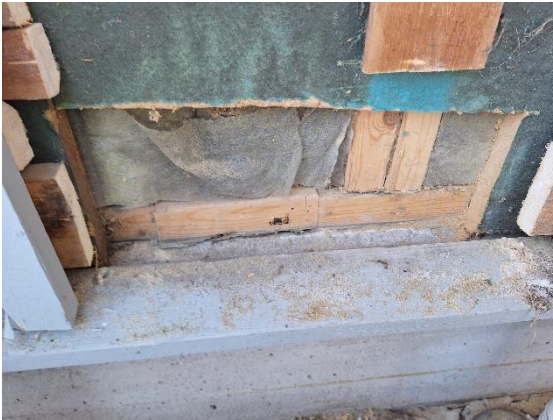
Kuva 53 US9. Eristeen ulkopinta on tummunut- ta.
