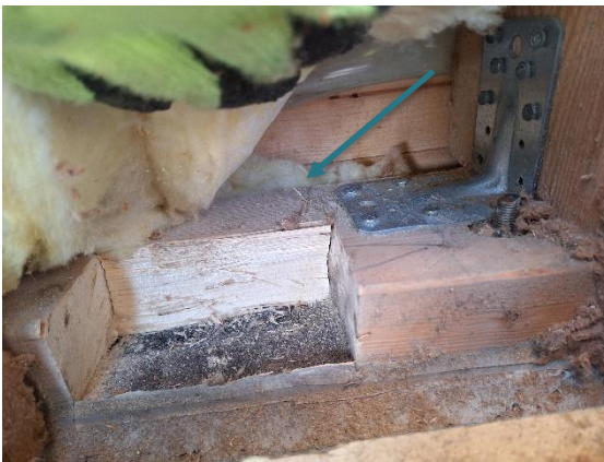
Kuva 50 US8, alaohjauspuussa ei ollut valuma jälkiä. Alaohjauspuun takana on villaa-eristettä.
