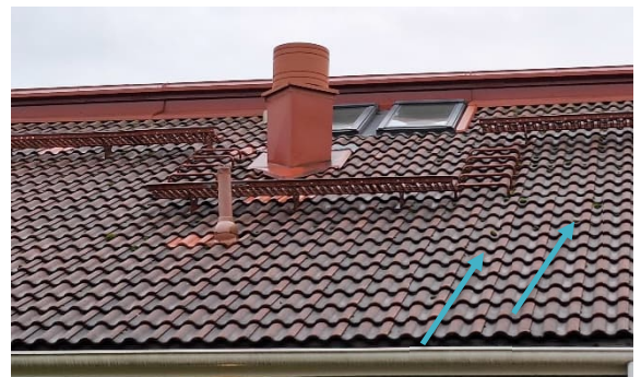
Kuva 103 Muutamia tiiliä on vaihdettu katolta läpivientien alapuolelta. Kuvan oikealla puolella (nuolet) on hieman sammalkasvustoa.
