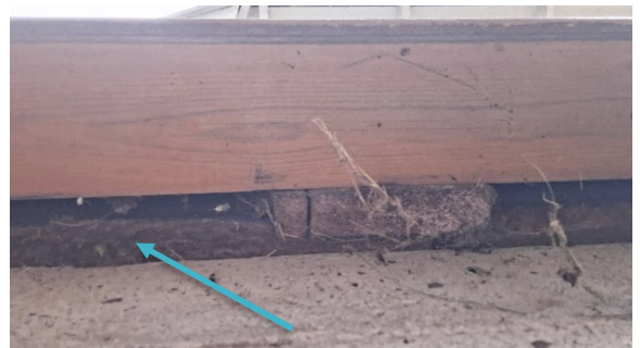
Kuva 43 Julkisivun tuuletusrako on riittävä. Julkisivun alaosaan puuttuu eläinverkko. Kuvassa näkyy julkisivun vaakalauta, sen takana pystykoolaus sekä tuulensuojalevyä (nuoli).
