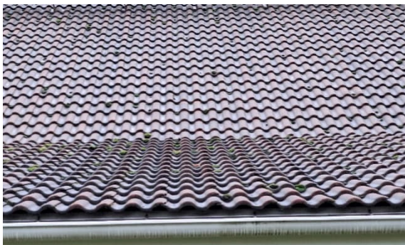
Kuva 102 Väestösuojan katolla ja sen yläpuolisella katolla on paikoin sammalkasvustoa.
