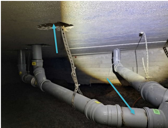
Kuva 18 Alapohjatilalan viemäriputkea. Etuosan mutkasta puuttuu kannake, ja kannakoinnit on tehty reikänauhalla. Läpivien- nissä ei havaittu tiivistystä.
