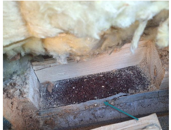
Kuva 44 US7, alaohjauspuun alla on bitumi ja puun alareunassa tiivistysmassa.
