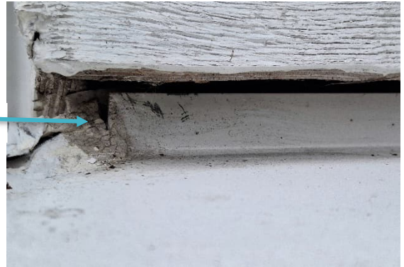
Kuva 41 Ikkunapellissä on ylösnosto, mutta ei tiivistystä yläosassa. Kulmauksessa on myös ylimääräistä rakoa.
