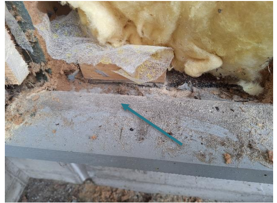
Kuva 66 US11. Vaakalaudan ja lomalaudoituksen väliin jää likaa.
