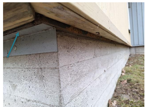
Kuva 22 US3B. Väestösuoja pitkällä sivulla oli kapea pelttilista suojaamassa tuulen-suojalevyä. Pellissä ei ole tippanokkaa.
