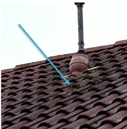
Kuva 104 Antennin läpiviennin alapuolella on hieman sammalkasvua.
