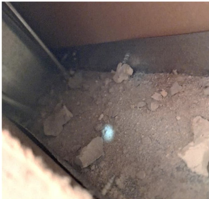
Kuva 80 VS5. Väliseinässä ei ollut eristeitä.
