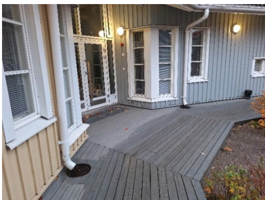
Kuva 12 Kattovedet ohjautuvat rännejä ja syöksyjä pitkin sadevesikaivoihin. Terrassi kastuu reunoilta ja syöksyjen kohdilta sateella.
