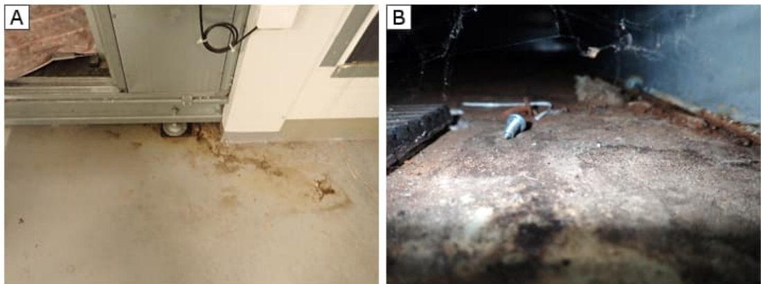
Kuva 116 a-b. Iv-konehuoneissa on paikoin lattiapinnoilla (iv-koneiden ulko-/tuloilmakammion alla) jälkiä seisoneesta vedestä, joka viittaa veden ja/tai tuiskulumen pääsyyn tuloilmasuodattimille. Kuvissa on iv-kone TK8.
