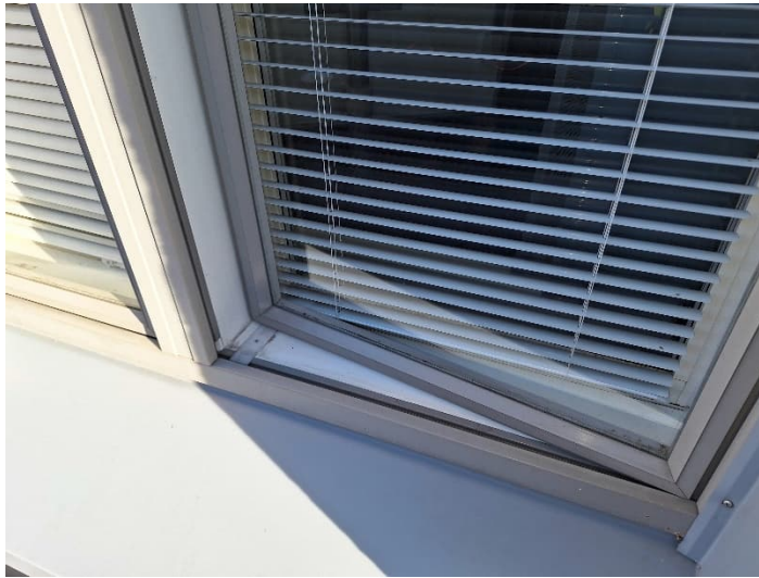
Kuva 77. Tarkastetuilta osin havaittiin, että ikkunoiden ulkopuitteita on kokonaan auki ja sadevesi pääsee ikkunoiden väliin.
