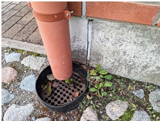
Kuva 6. Havaintojen perusteella tiilikatteisien vesikattojen vedet ohjautuvat syöksytorvista hallitusti sadevesikaivoihin. Paikoin perusmuurin pinnalla on viitteitä roiskevesistä, kuten tummentumaa ja viherkasvustoa. Kohdissa, joissa syöksytorven läheisyydessä on perusmuurin elastiset elementtisaumat, on riskinä, että roiskevedet kulkeutuvat epätiiviistä saumakohdista rakenteeseen (ks. luku 7.2).
