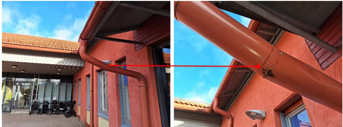
Kuva 5. Solun D / Haikko länsijulkisivu. Katoksen syöksytorven jatkokohdan liitos on löystynyt ja osittain irti.
