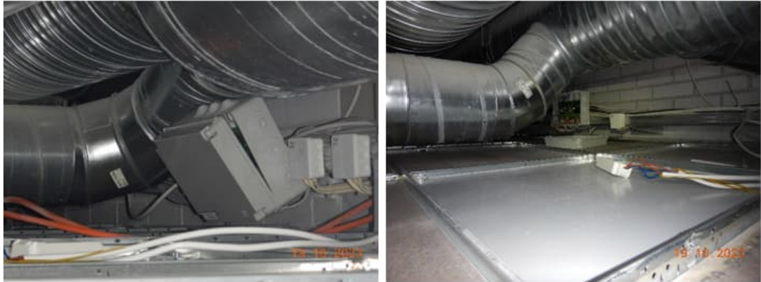
Kuva 59 a-b. Alakattojen sisällä on ilmeisesti luokahuoneiden sähköihin ja automaatioon liittyviä kytkentälaatikoita. Suuri osa laatikoista oli raoillaan tai kokonaan auki alakattojen sisällä.
