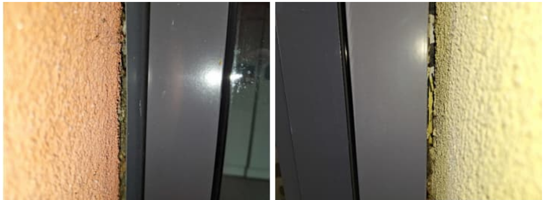
Kuva 67 a-b. Rakennuksen julkisivupellityksissä on maantasosta katselmoituna useita kohtia, joissa pelti ei ole tiiviisti rappauspinnassa kiinni eikä liittymää ole kitattu. Korkeammalla olevia pellitysten liittymiä ei tarkastettu katselmuksen yhteydessä.
