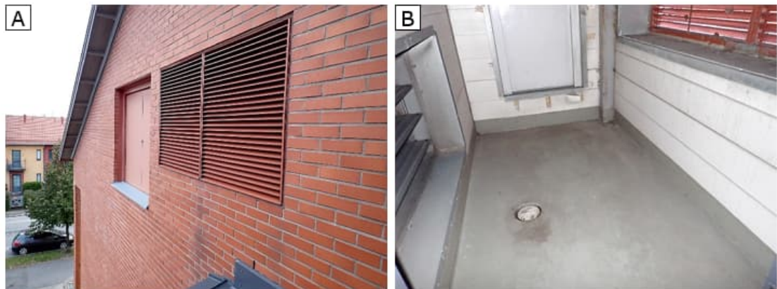
Kuva 112 a-b. Yleiskuvat ulkoilmasäleiköstä ja ulkoilmakammioista (solu G). Kuvan B kammiossa on kosteusjälkiä, jotka viittaavat veden ja tuiskulumen pääsystä kammiioon.
