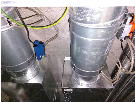
Kuva 129. Koulurakennusten käytävien alakattotiloissa on käytöstä poistettuja ilmamääräsäätimiä (IMS).
