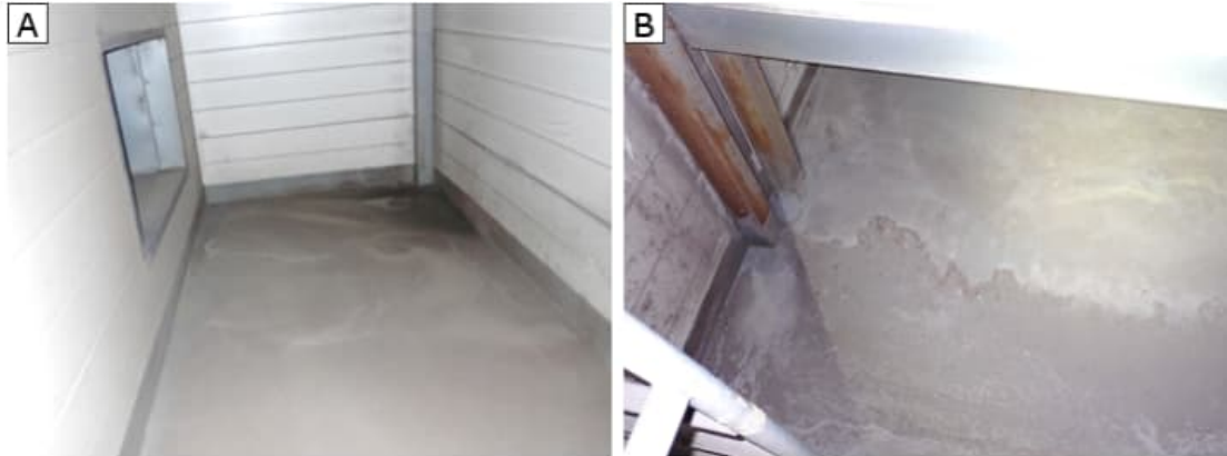
Kuva 113 a-b. Yleiskuvat ulkoilmakammioista (solu F). Metallirakenteissa on korroosiovaurioita ja kammionpohjalla on kosteusjälkiä (kuva B).
