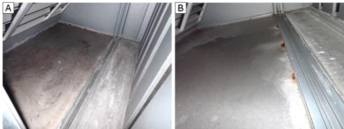
Kuva 120 a-b. Lto-osien kammioiden pohjilla on jälkiä seisoneesta vedestä ja paikoin korroosioaurioita. IV-koneen TK8 kammion pohjalle kaadettiin vettä ja silmämääräisesti arvioituna se lammikoitua kammion pohjalle. A kuvassa on iv-kone TK09 ja B kuvassa on TK08.
