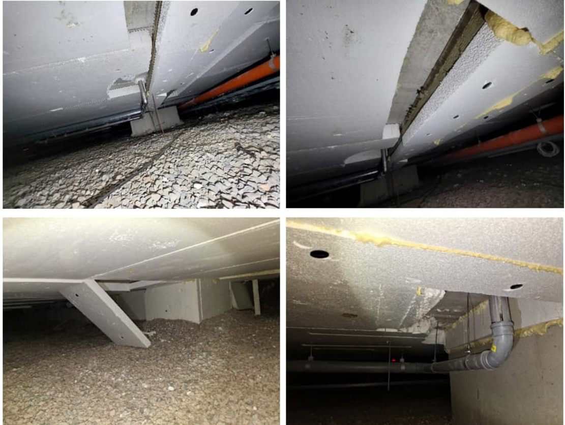
Kuva 28 a-d. Ryömintätilassa on runsaasti erilaisia eristepuutteita. Yleisin puute on läpiviennin kohdalla irronnut/repeytynyt eriste. Lisäksi useita muutamien neliömetrien kokoisia alueita, joista eriste puuttuu kokonaan. Paikoin eristeet ovat myös irronneet kiinnityksestään.
