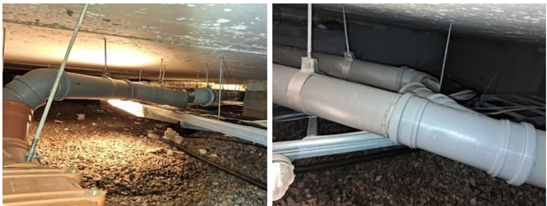
Kuva 21 a-b. Ryömintätilassa havaittiin runsaasti eritasoisia kannakointipuutteita sadevesiviemäröinneissä. Heikosti toteutetun kannakoinnin vuoksi putkia on irronnut liitoksista ainakin liikuntasalin ja sähköpääkeskuksen 1133 kulmauksen kohdalla. Viemäriputkia ei ole eristetty ryömintätilassa.
