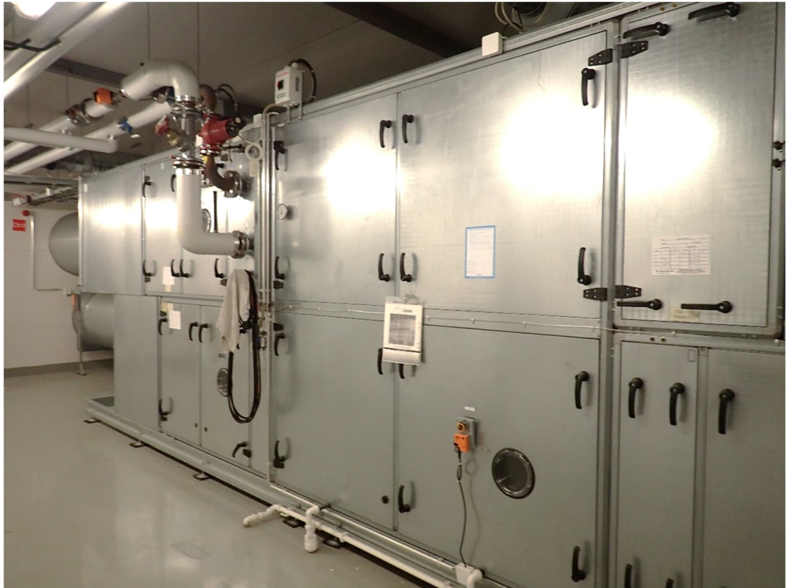
Kuva 115. Yleiskuva tulo- ja poistoilmanvaihtokoneesta (kuvassa iv-kone TK09).
