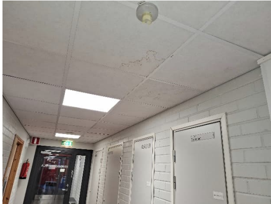
Kuva 55. Solun I, 1krs. käytävällä on useita alakattolevyjä, joissa on kosteuden aiheuttamia jälkiä. Jälkien kohdalla ei havaittu aktiivisia kosteudenlähteitä. Vuotojälkien kohdalla on jäähdytysputkia, jotka havaintojen mukaan on eristetty jälkikäteen. Vuotojälkien mahdollinen syy on jäähdytysputkien pintaan ennen eristystä kondensoitunut kosteus.
