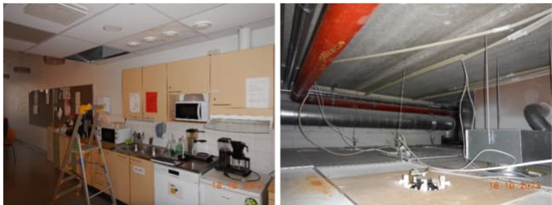
Kuva 60 a-b. Solun I / Olkkalaa, tilassa 2042 on alakaton sisällä kulkevassa viemäriputkessa useita halkeamia ja aktiivisia vuotokohtia. Alakattolevyissä on vuotojälkiä.
