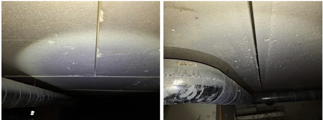
Kuva 20 a-b. Tarkastetuilla osin EPS levysaumoja ei ole pääosin tiivistetty ryömintätilassa, vaan levyt on asennettu puskuun ja auenneissa saumoissa on havaittavissa ontelolaatan alapinta.
