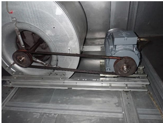
Kuva 122. Yleiskuva puhaltimesta. Tulo- ja poistoilmapuhaltimet ovat hihnavetoisia ja varustettu erillisellä sähkömoottorilla.
