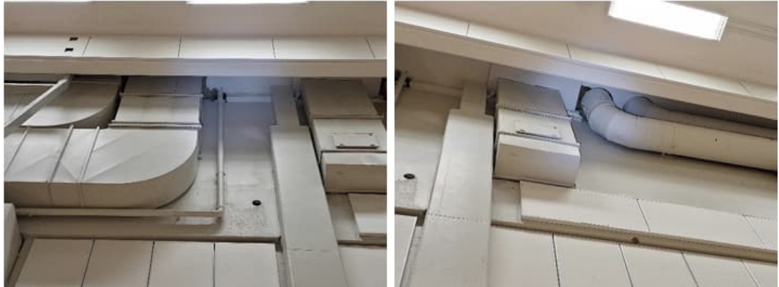
Kuva 111 a-b. Liikuntasalin katossa on paljaita villapintoja näkyvissä IV-kanavien läpivienneissä. Yläpuolelta ullakkotilasta tarkasteltuina liittymissä on palokatkomassa.
