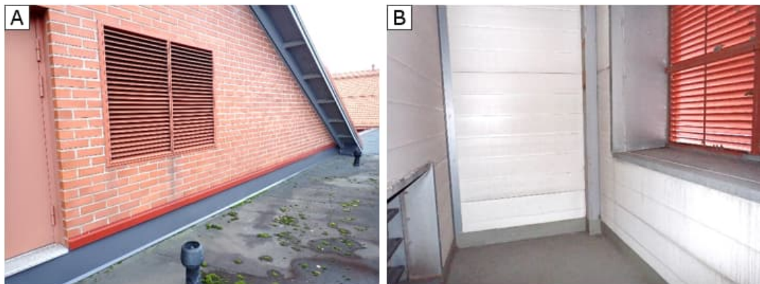
Kuva 114 a-b. Yleiskuvat ulkoilmasäleiköstä ja ulkoilmakammioista (solu E). Säleikkö on lähellä kattopintaa ja kammiossa on jälkiä veden, sekä tuiskulumen pääsystä kammioon.
