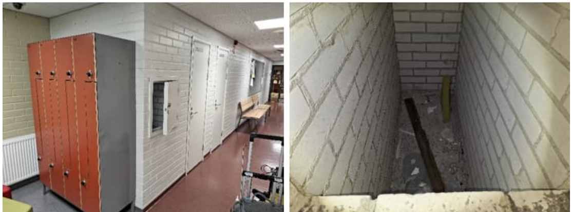
Kuva 87 a-b. C2 Inkala, käytävä 2015 tekniikkakuilun tarkastusluukku. Kuilun sisällä on yksittäinen lauta sekä vähän rakennusjätettä.
