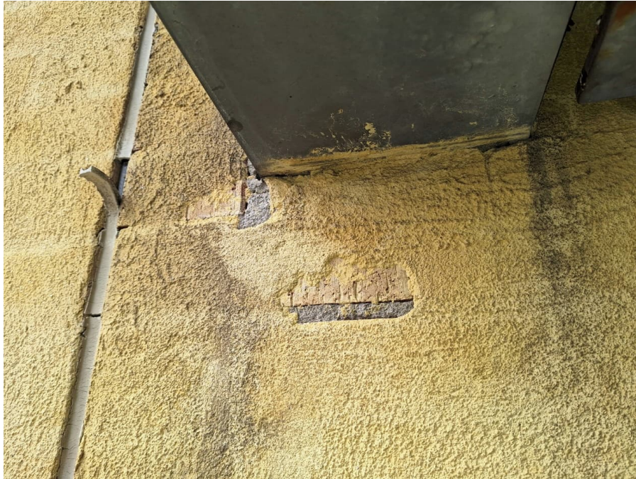
Kuva 66. Saumojen puutteiden lisäksi porrastasanteiden kohdalla julkisivun rappauspintaan kohdistuu ylimääräistä kosteusrasitusta, ja rappauspinta on värjäätynyt sekä osittain irronnut. Paikoin rappauksen irtoaminen johtuu ilkvallasta.
