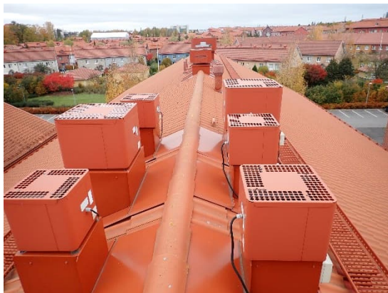
Kuva 123. Yleiskuva vesikatolla sijaitsevista huippuimureista.
