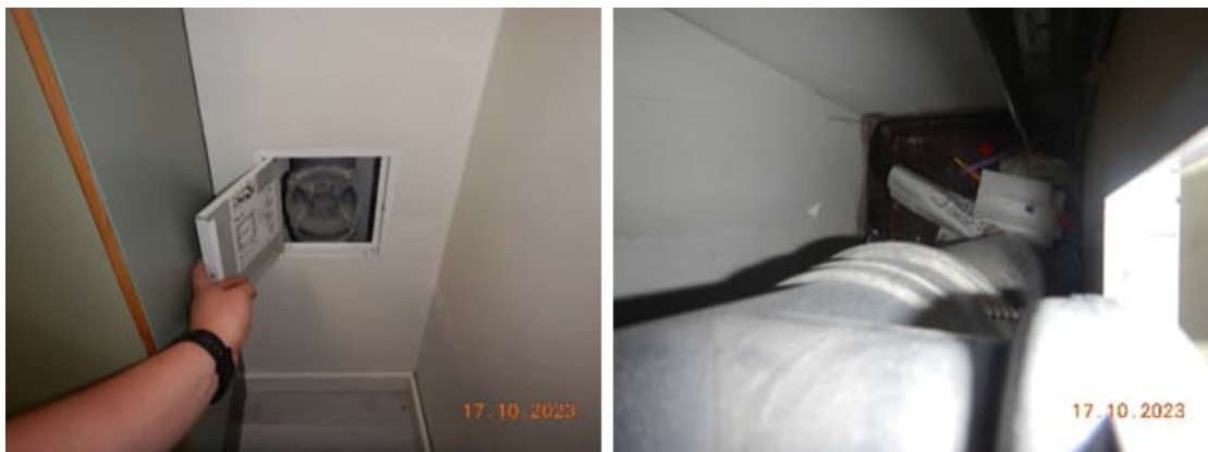
Kuva 37 a-b. D1 / Haikko, Luokkahuone 1176, Sadevesiviemäröinnin putkiläpivienti alapohjan läpi. Läpivientiin on tehty ilmatiiveyden
