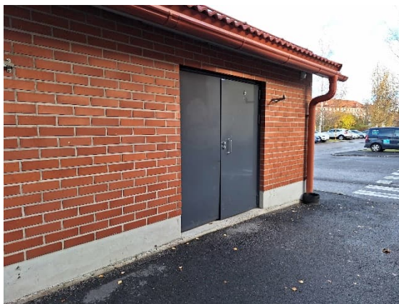
Kuva 8. Rakennuksen pohjoisjulkisivulla sijaitsevan jätevaraston metallinen ulko-ovi on vääntynyt (käyntiongelma).
