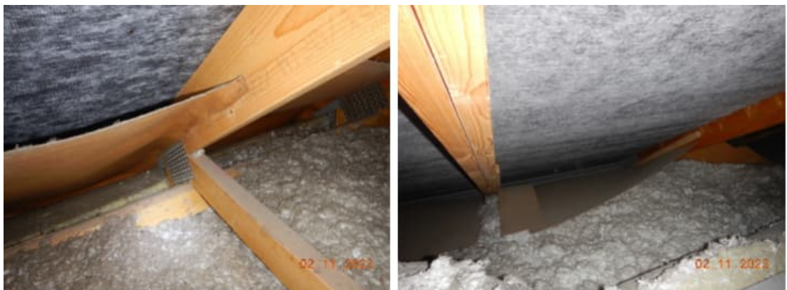
Kuva 102 a-b. Vesikaton räystääslinjalle on asennettu pahvisia tuulenohjaimia. Osa tuulenohjaimista on kiinnitetty pelkästään nitomalla ja osa puurimojen avulla. Räystäällä havaittiin useassa kohdassa irronneita
