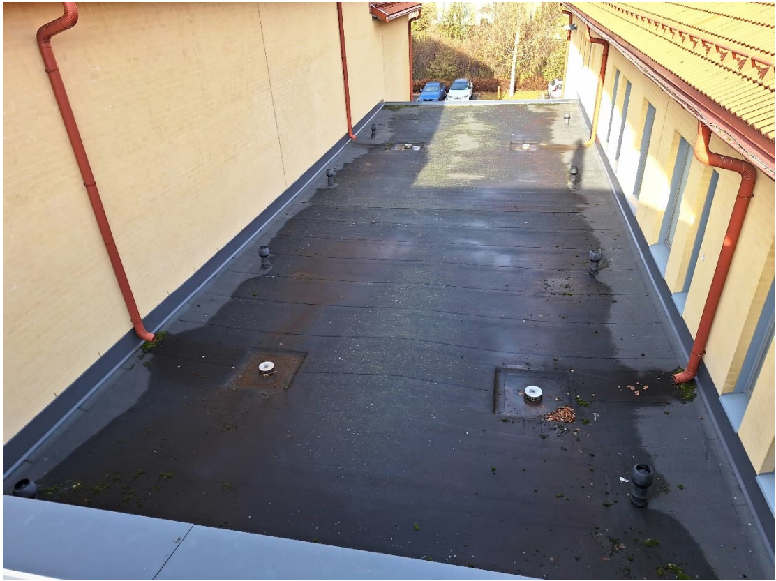
Kuva 99. Solujen H ja I välissä [redacted] yläpohja on kermikatettu tasakatto, jonne harjakattojen sadevedet on johdettu syöksytorvia pitkin. Syöksytorvista tuleva vesi kastelee syöksytorven kohdalla olevia rakenteita ja pitää pinnat kosteana.
