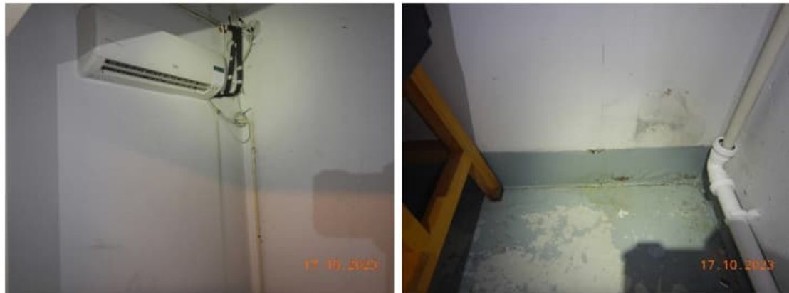
Kuva 80 a-b. Solu I, tilojen 1122 ja 1116 välisessä väliseinärakenteessa havaittiin ilmalämpöpumpun sisäyksikön kondenssivesivuodon aiheuttama kosteusvaurio. Seinän alareuna oli tarkastushetkellä märkä.
