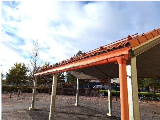
Kuva 7. Etelän puoleisen sisäpihan katosten rännikourut ovat paikoin vääntyneet, todennäköisesti ilkvallan seurauksesta.
