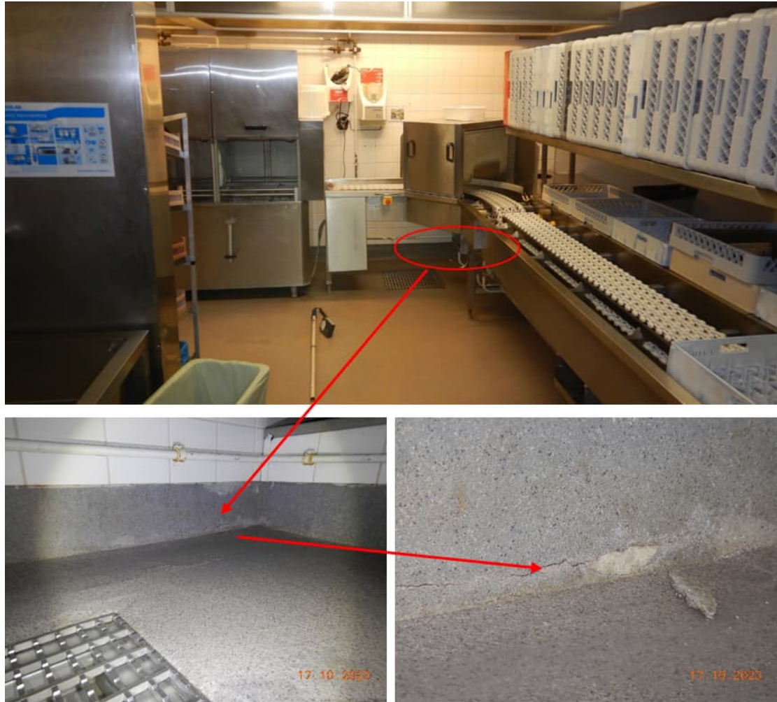
Kuva 16 a-c. Solun C1/Ruukki, astianpesutilan 1084 akryylibetonipinnoitteessa on halkeama ja pinnoite on irronnut seinäliittymästä. Tällä kohtaa ei kuitenkaan havaittu kohonneita vertailuarvoja pintakosteudenosoittimella.
