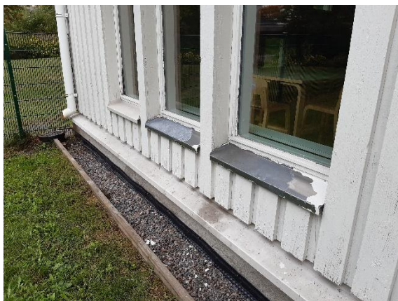
Kuva 35. Vesipeltien maalipinnoite on irronnut lähes kokonaan.
