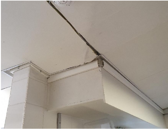
Kuva 52. Keittiön kattolevy on lohjennut nurkasta.
