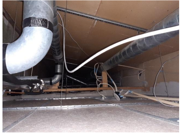
Kuva 53. Lasketetut alakattotilat ovat pääosin siistejä.
