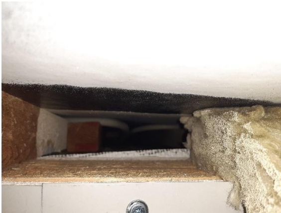
Kuva 64. Akustiikkalevyn yläpuolelta ilmayhteys väliseinän eristekerrokseen.
