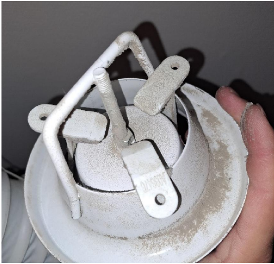
Kuva 86 Poistoilman pääte-elimessä on pölyä ja tiivistysrenkas puuttuu.
