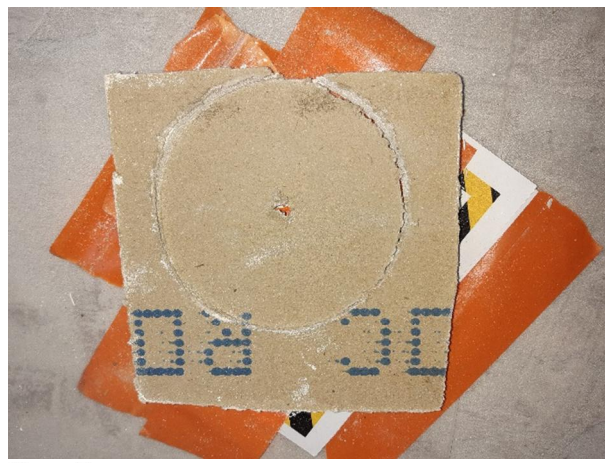
Kuva 2. Kipsilevyn ulkopinnassa havaittiin vähäisesti mikrobikasvustoon viittaavia jälkiä.
