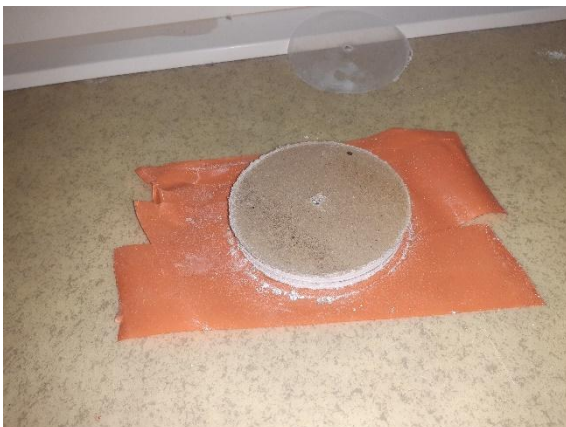
Kuva 33. RA-US15. Kipsilevyn pinnassa havaittiin likaantumista, mahdollista mikrobikasvustoa.
