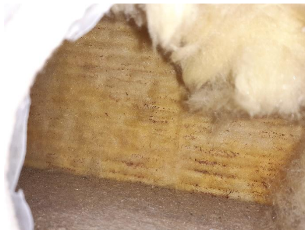
Kuva 2. Tuulensuojalevyn sisäpinta on likainen.
