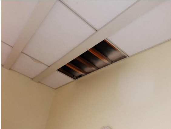
Kuva 62. RA-YP1. Rakennetta avattiin väliseinän vierestä, kosteusjäljen kohdalta.
