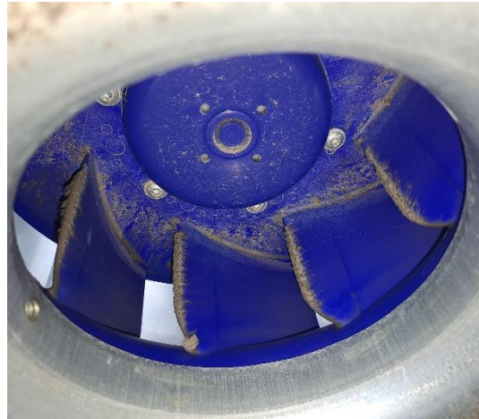
Kuva 8. Siipipyörässä on alkavaa pölykerrostumaa
