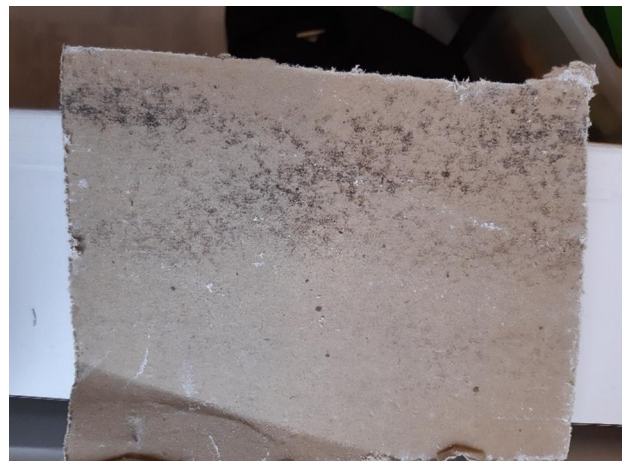
Kuva 2. Kipsilevyssä havaittiin mikrobikasvustoon viittaavia jälkiä.
