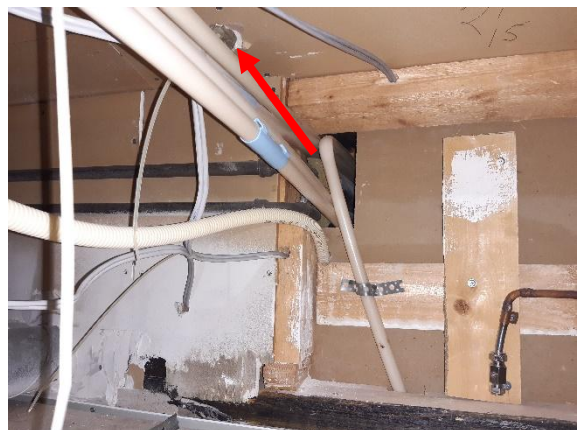
Kuva 57. Alakattotilassa tulpattuja vesi-putkia ja mineraalivillalla tukittuja läpi-vientejä.
