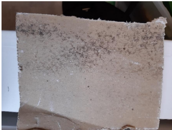
Kuva 25. RA-US1. Kipsilevyn ulkopinnassa näkyvää mikrobikasvustoa.
