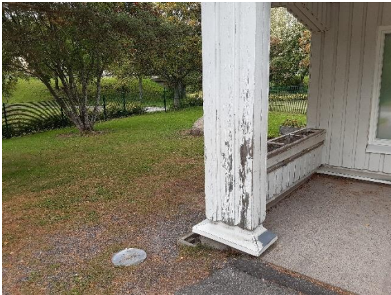
Kuva 21. Pilarin laudoituksen maalipinta kulunut.
