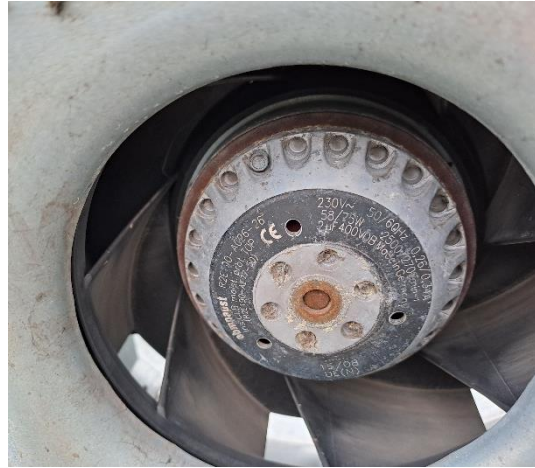
Kuva 12. Siipipyörässä on alkavaa pölykerrostumaa
