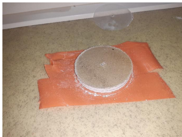
Kuva 2. Kipsilevyn ulkopinnassa havaittiin viitteitä mikrobikasvustoa.
