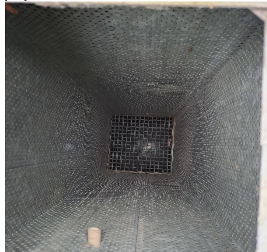
Kuva 14. Runkokanavassa on alkavaa pöly ja liiakertymää
