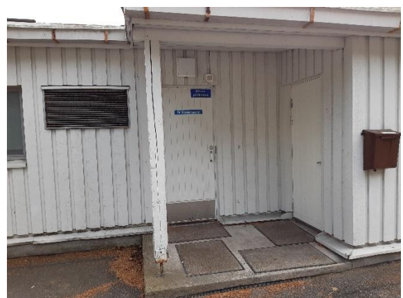
Kuva 24. Pohjoispuolen katoksen puupilari on haljennut.
