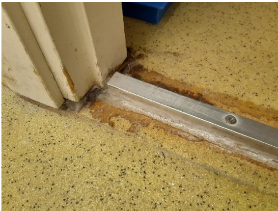
Kuva 12. Keittiön ja kuiva-ainevaraston välinen kynnyks on likaantunut ja värjäntynyt.
