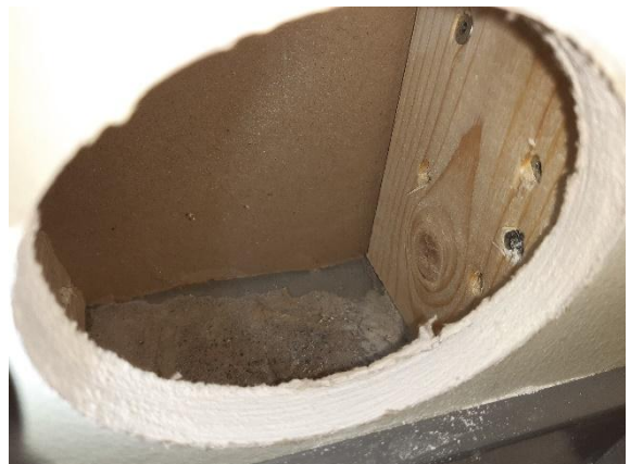
Kuva 51. RA-VS15. Väliseinän alareunassa ei ole lämmöneristettä.
