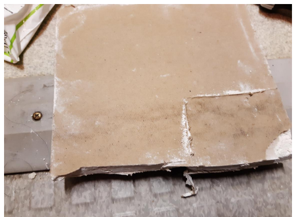
Kuva 45. RA-VS5. Väliseinän kipsilevy on mikrobivaurioitunut.
