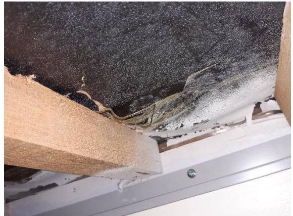
Kuva 65. Yläpohjan tiivistyslevyn ja ulkoseinän liitoksen teippaus on epätiivis.
