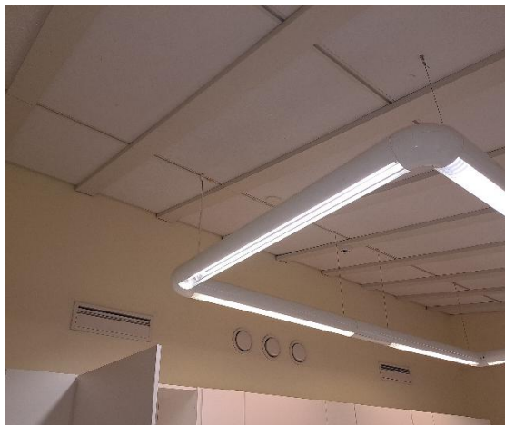
Kuva 84. Tulo- ja poistopääte-elimia le-pohuoneen seinällä
