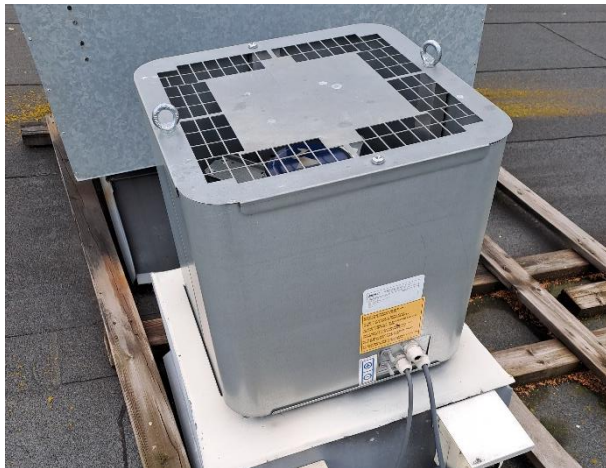
Kuva 7. Yleiskuva PP1.2 huippuimurista
