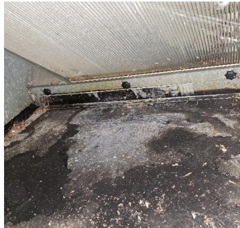
Kuva 4 LTO tulokammiossa on kosteusjälkiä ja roskaa
