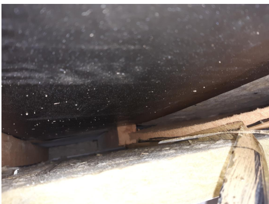
Kuva 66. Tiivistelevyjen väliset teippaukset ovat paikoin epätiiviiit.
