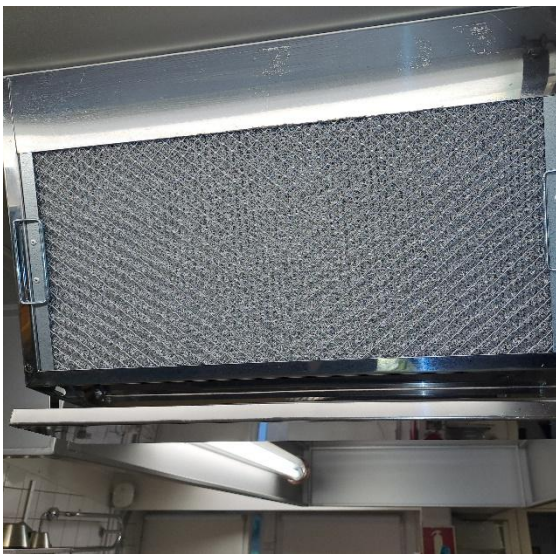
Kuva 83. Yleiskuva keittiön rasvasuodattimesta
