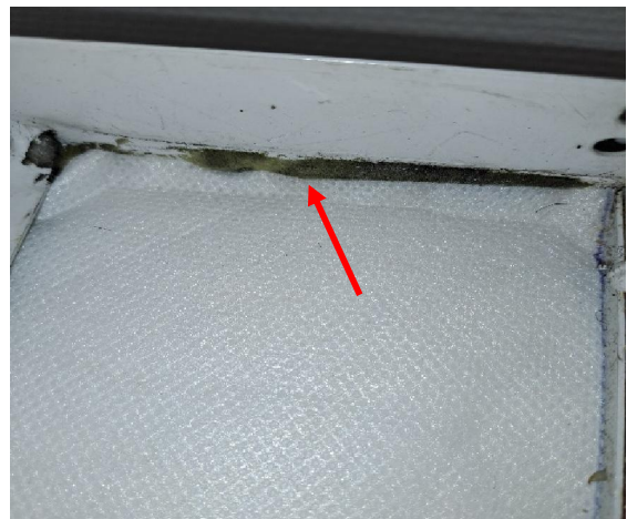
Kuva 85. Pääte-elimien on jäänyt vanhaa mineraalivillaa
