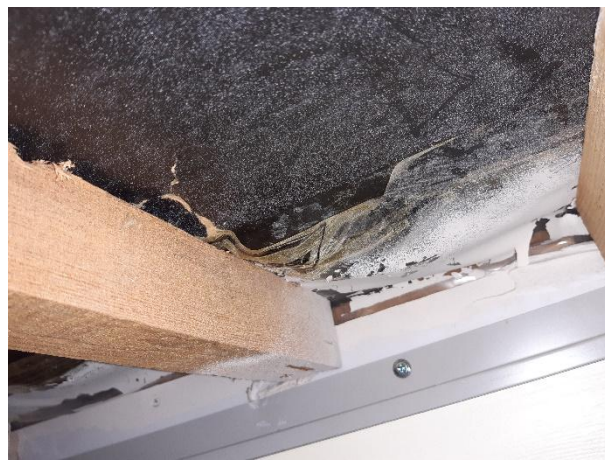
Kuva 2. YP-US-liittymän teippaus on epätiivis.
