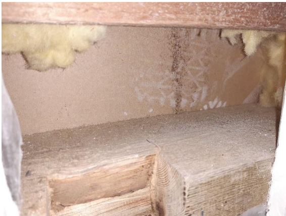
Kuva 48. RA-VS12. Kipsilevyn pinnassa pystysuuntaisia mikrobikasvuston jälkiä.
