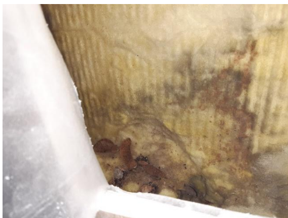
Kuva 27. RA-US3. Eristekerroksessa roskaa ja kosteusjälkiä.
