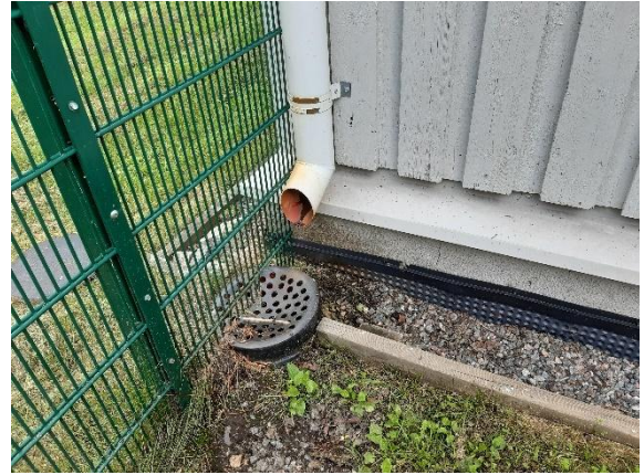
Kuva 59. Syöksytorven ulosheittäjä korroosioaurioitunut.
