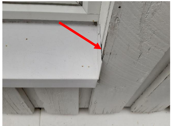
Kuva 38. Vesipellin liitosta ei ole tiivistetty.
