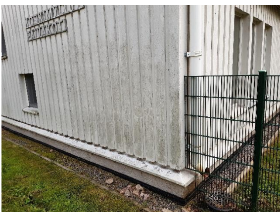
Kuva 23. Julkisivulaudoituksessa vähäisesti sammalkasvustoa pohjoissivulla.
