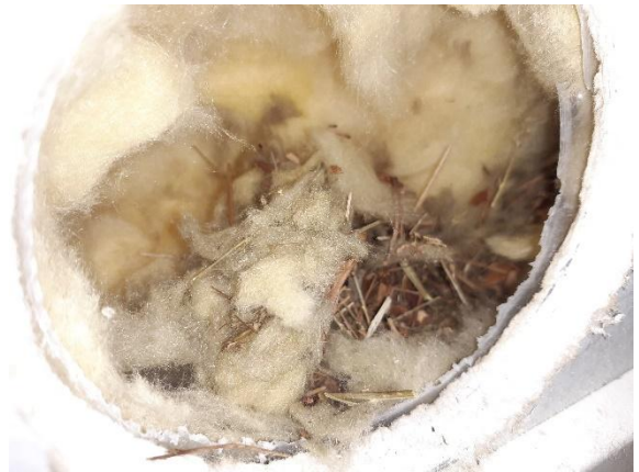
Kuva 32. RA-US15. Eristekerroksessa havaittiin pieneläimen pesän jäänteitä.
