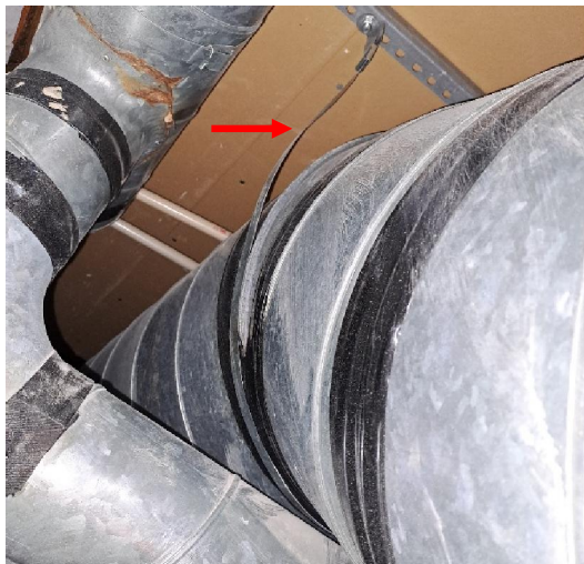
Kuva 77. Alkuperäistä kanavistoa alas lasketun katon yläpuolella. Kuvassa on havaittavissa löysä kannakointi.
