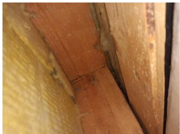
Kuva 28. RA-US5. Puurunko oli hyväkuntoinen.
