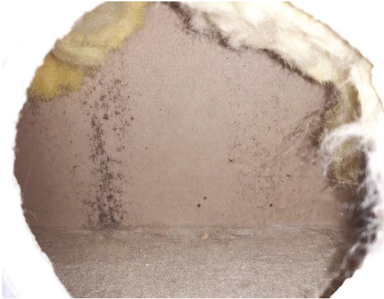
Kuva 46. RA-VS11. Kipsilevyn pinnassa havaittiin pystysuuntaisia mikrobikasvuston jälkiä.
