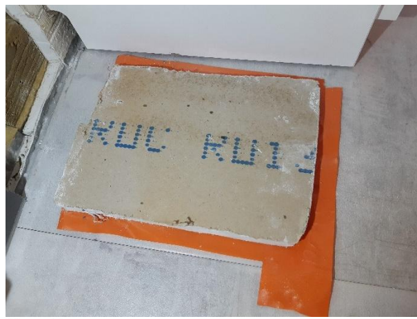
Kuva 2. Kipsilevyn ulkopinnassa havaittiin viitteitä mikrobikasvustoa.
