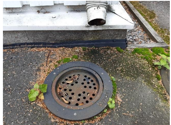
Kuva 61. Puutteellinen vedenpoisto rakennuksen pohjoissivulla.
