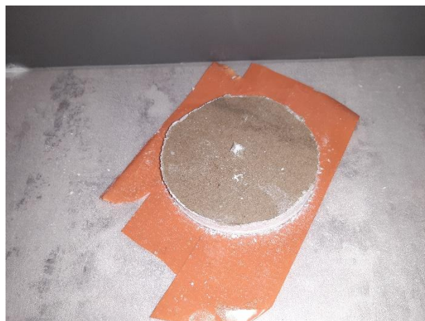
Kuva 2. Kipsilevyn ulkopinnassa havaittiin viitteitä mikrobikasvustoa.
