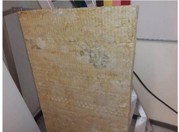
Kuva 63. RA-YP1. Akustiikkalevyn yläpinnassa havaittiin mikrobikasvustoa.
