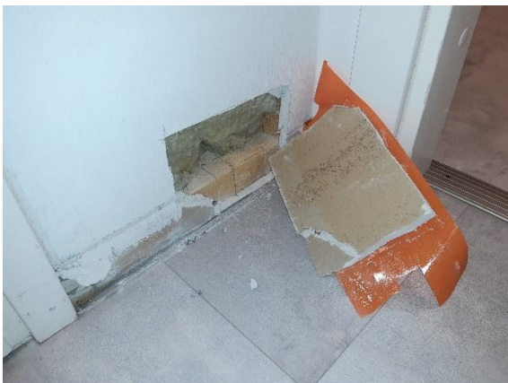
Kuva 50. RA-VS14. Mikrobikasvustoa käytävän ja WC:n välisessä väliseinässä.
