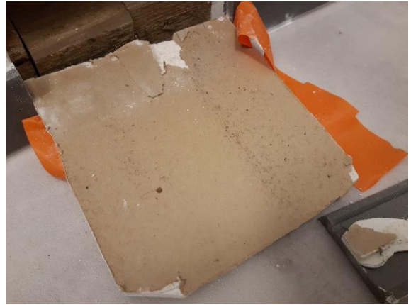
Kuva 47. RA-VS12. Kipsilevyn pinnassa havaittiin mikrobikasvustoa.
