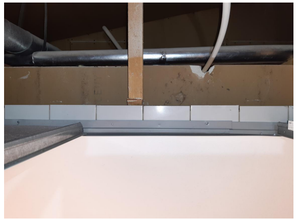
Kuva 55. Vanhan vesileikkitila 43:n väli-seinän kipsilevyssä kosteusjälkiä.
