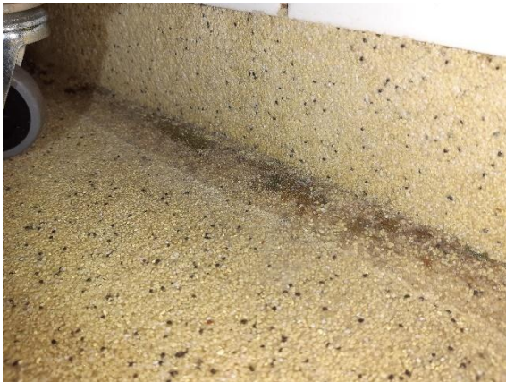
Kuva 14. Keittiön lattiapinta on värjäntynyt.
