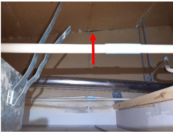
Kuva 54. Epätiiveyskohdasta näkyy mineraalivillaa.
