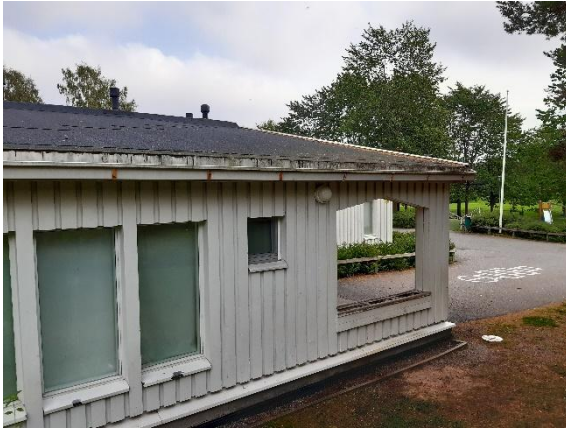
Kuva 58. Vesikouru on likainen. Vesikattolla havunneulasia. Vesikourun kannakkeet ovat korroosiotilassa.
