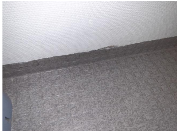
Kuva 11. WC 18a:n muovimaton ja väliseinän liitos on paikoin epätiivis.
