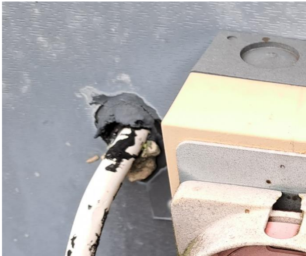
Kuva 13. Tiivistämättömät johtoläpiviennit mahdollistavat sadeveden pääsyn rakenteisiin
