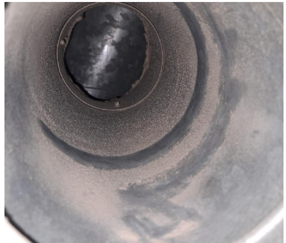
Kuva 82. PT-WC poistokanavan pölykertymä on alle 1,4 \text{ g/m}^2
