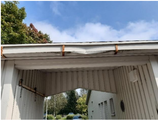
Kuva 60. Vesikouru on vaurioitunut.
