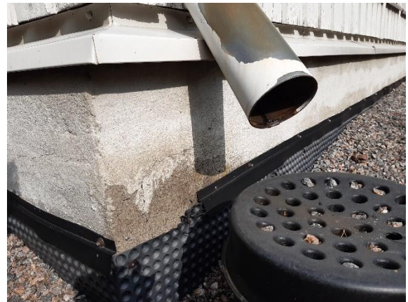
Kuva 20. Sokkeli kastunut ja vaurioitunut syöksytorven ulosheittäjän kohdalla.
