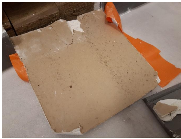
Kuva 2. Kipsilevyn pinnassa pystysuuntaisia jälkiä.
