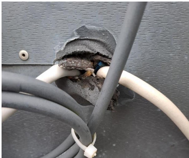
Kuva 9 Tiivistämättömät johtoläpiviennit mahdollistavat sadeveden pääsyn rakenteisiin
