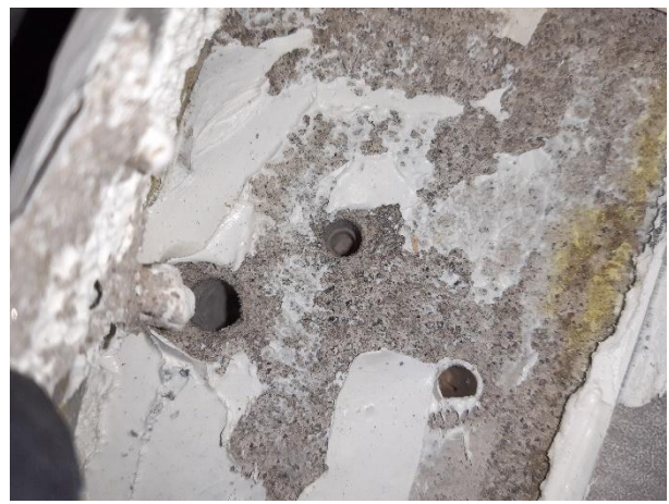
Kuva 4. Alapohjalaatassa ruuvireikiä. Reiät eivät ole porattu pintalaatan läpi.
