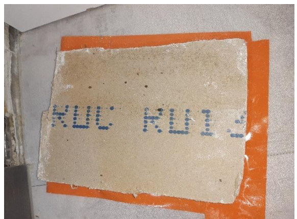
Kuva 34. RA-US16. Ulkoseinän kipsilevyn ulkopinnassa havaittiin mikrobikasvustoa.
