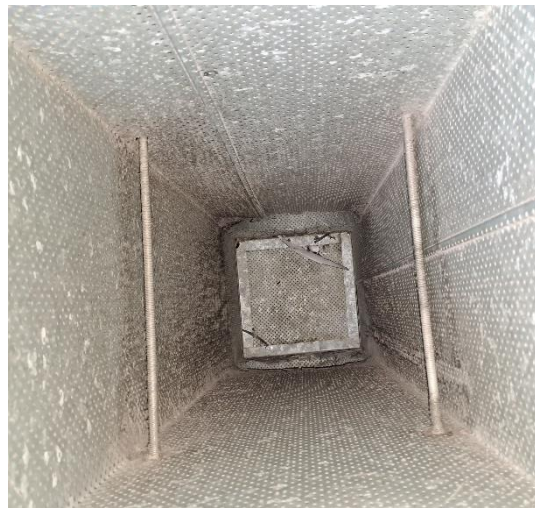
Kuva 10 Runkokanava on likainen ja kanavan pohjalla on roskaa
