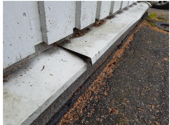
Kuva 22. Sokkelin vesipelti irronnut pohjoisjulkisivulla.
