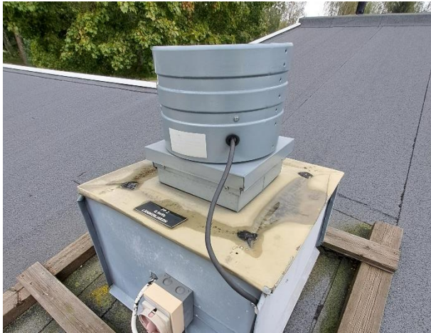
Kuva 11. Yleiskuva PP 2 huippuimurista
