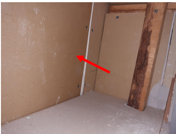
Kuva 56. Tilassa 05 ulkoseinän kipsilevy on todennäköisesti kastunut asennus-vaiheessa.
