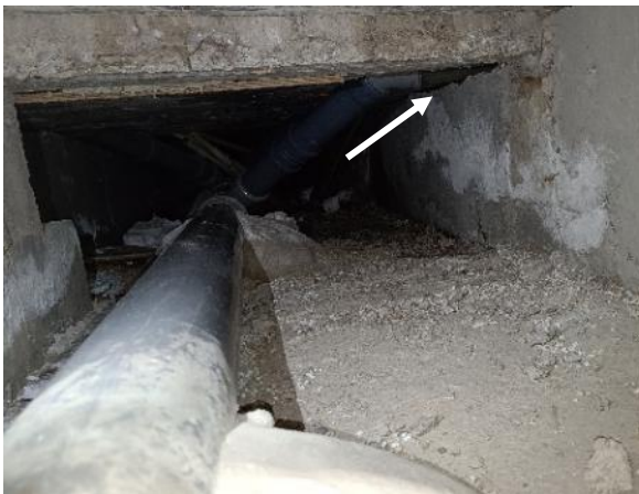
Kuva 15 Viemäri kulkee putkikanaalin seinämän yli nuolen osoittamassa kohdassa, eli kanaalista on ilmayhteys alapohjan eristetilaan.
