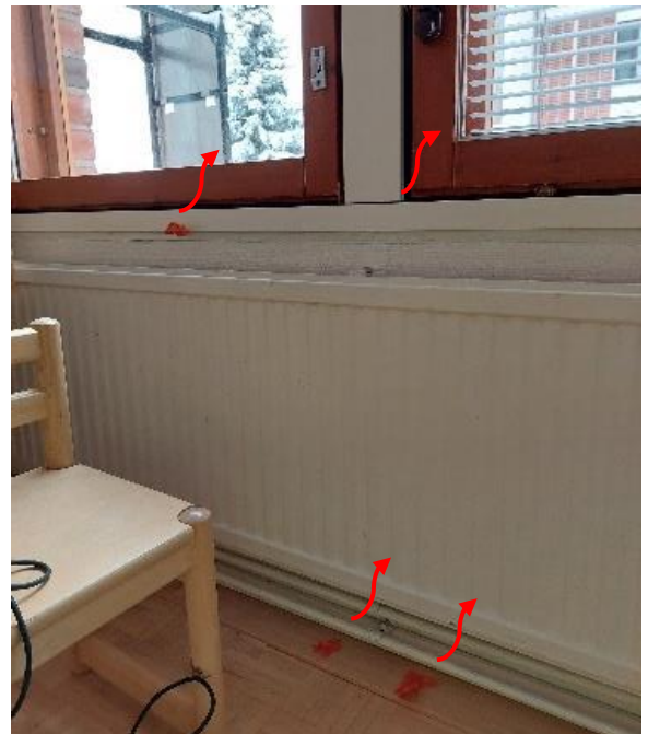
Kuva 84 MA8, Liikuntasali 21. Selkeä ilmavuotoa havaittiin lattian ja ulkoseinän liitoskohdassa ja ikkunan ja ulkoseinän liitoskohdissa.
