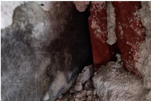
Kuva 40 Avaus 1. Tiilen ja tuulensuojalevyn välissä on 20...30 mm ilmarako. Laastipurseet heikentävät paikoin tuulettumisedellytyksiä.
