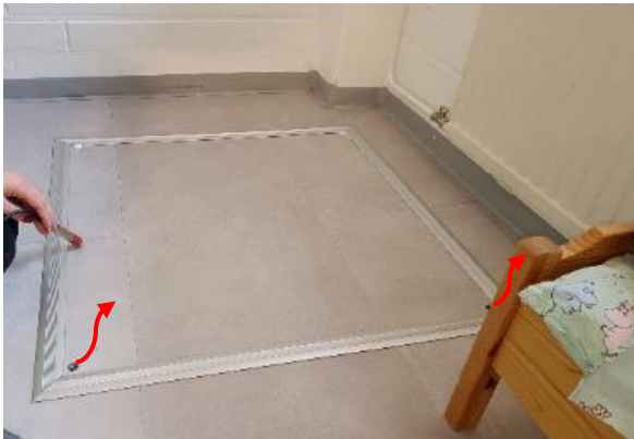
Kuva 22 MA1. Tulppaukset lattialuukun kahdessa muussa kulmassa estivät ilmvuodon sisätilaan.
