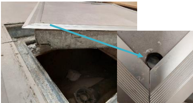
Kuva 13 Luukun yhdestä kulmasta puuttuu mutteri ja aukko on avoin. Mutterin kohta osuu alemman rakenteen metallisen reunan sisäpuolelle.
