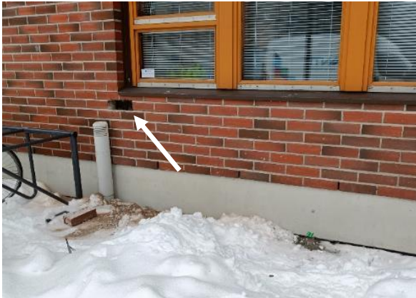
Kuva 38 Avaus 1 tilan 02 ikkunan alapuolella.
