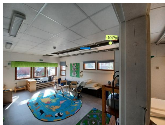
Kuva 15. Tilan 11 (MAK10) merkkiaineen syöttökohta merkattu sinisellä nuolella. Kaasua syötettiin myöhemmin myös paineeron mittauskohdasta. Kaasu kulkeutuu hyvin saumaan tehtyjen reikien välillä eikä tiivistyskorjausten saumoissa havaittu vuotokohtia.
