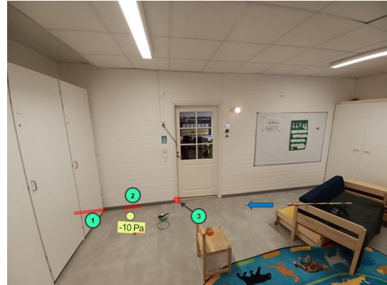
Kuva 7. Tilan 43-44 (MAK2) väliseinän ja alapohjan liittymissä esiintyneet vuotokohdat.
