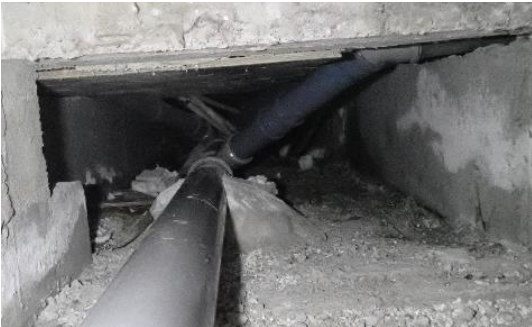
Kuva 20. Tähystettäessä kauemmaksi kanaaliin voidaan kanaalissa olevan edelleen rakennusjätettä
