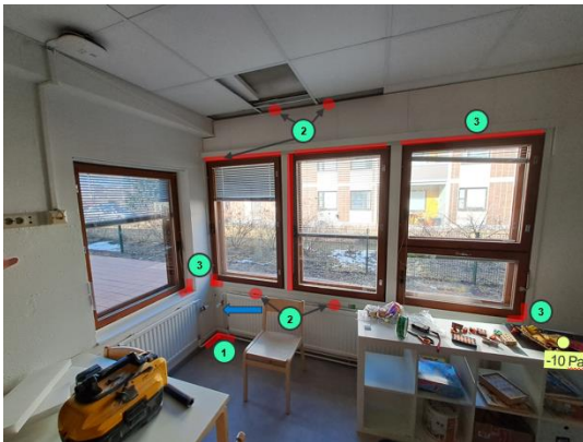
Kuva 6. Tilan 43 (MAK1) merkkiaineen syöttökohta merkattu sinisellä nuolella ja rakenteen paine-ero keltaisella pallolla. Kaasua syötettiin myöhemmin myös paineeron mittauskohdan reiän kautta. Havaitut vuotokohdat merkattuna kuvaan punaisella.
