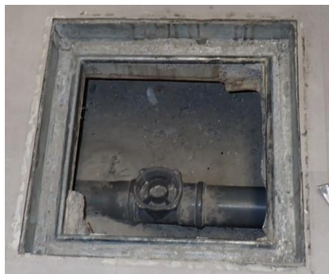
Kuva 17. Nykytilanne lattialuukun kohdalla. Luukun kaulus on vaihdettu, mutta kanaalin pohjalla näkyy edelleen hienoa rakennusjätettä.
