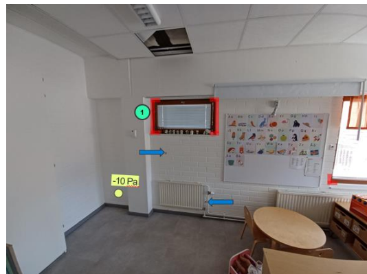
Kuva 11. Tilan 44 (MAK6) merkkiaineen syöttökohdat merkattu sinisillä nuolilla. Merkittävää viivamaista vuotoa havaittiin ikkunatiivistysten nurkka-alueilla sekä pystyosuuksilla.
