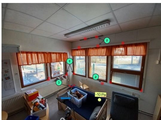
Kuva 12. Tilan 36 (MAK7) merkkiaineen syöttökohta on merkitty sinisellä nuolella. Merkittäviä vuotokohtia havaittiin ikkunatiivistysten nurkka-alueilla sekä rakenteen läpäisevien kiinnikkeiden kiinnityskohdista.
