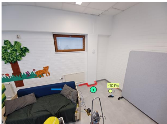
Kuva 10. Tilan 44 (MAK5) merkkiaineen syöttökohta merkitty sinisellä nuolella. Merkittävää viivamaista vuotoa pilarin ja alapohjan liittymäkohdista.
