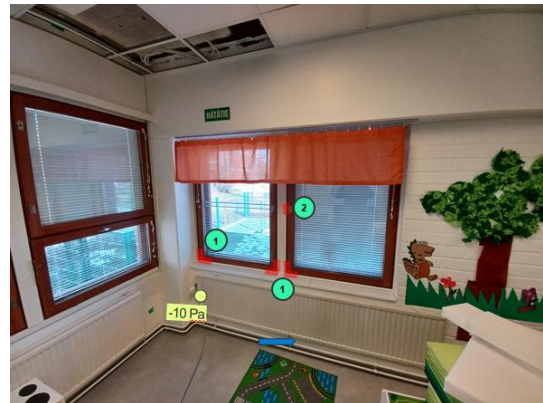
Kuva 9. Tilan 43 (MAK4) merkkiaineen syöttökohta merkitty sinisellä nuolella. Merkittävää viivamaista vuotoa havaittiin ikkunatiivistysten nurkka-alueilla.
