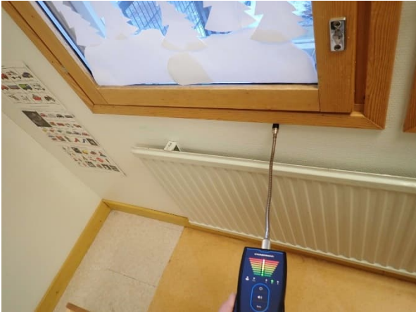
1. Ikkunaliittymän alareunasta todettiin merkittävää ilmavuotoa kauttaaltaan. Vuodot todettiin sekä normaaleissa käyttöolosuhteissa että tilan ollessa alipaineistettu.
