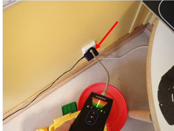
2. Sähkörasiasta todettiin merkittävää pistemäistä vuotoa.
