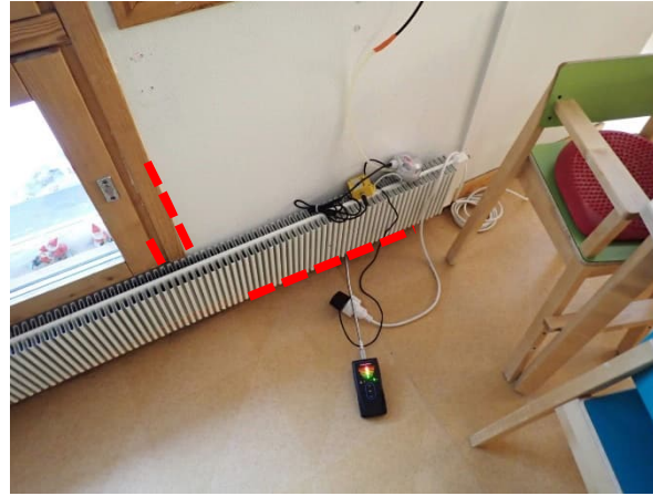
2. Alapohjan ja ulkoseinän liittymästä sekä ikkunaliittymästä todettiin merkittävää rakomaista ilmavuotoa normaaleissa käyttöolosuhteissa sekä tilan ollessa alipaineistettuna.
