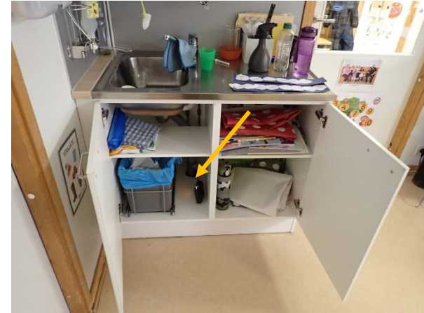
3. Vesipisteen putkiläpiviennistä todettiin vähäistä ilmavuotoa.
