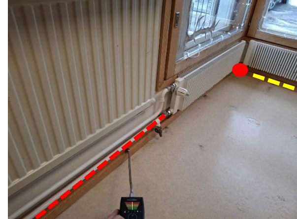
Ulkoseinän ja alapohjan välisestä liittymästä todettiin merkittävää tai vähäistä, pääosin laaja-alaista ilmavuotoa.
