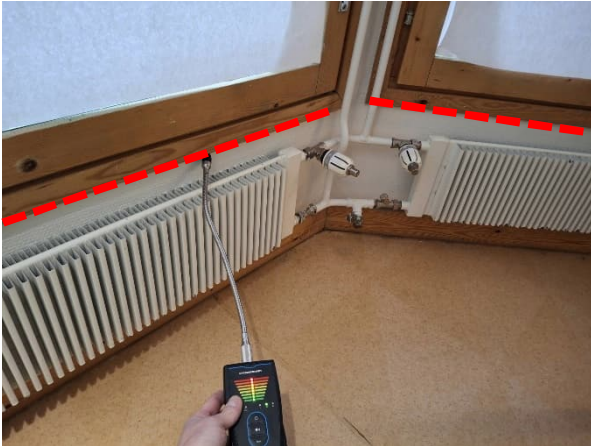
1. Ikkunaliittymistä todettiin merkittävää laaja-alaista ilmavuotoa ulkoseinän erkkeriosuudella tilan normaaleissa käyttöolosuhteissa.
