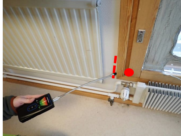
2. Lounaanpuoleisella ulkoseinälinjalla todettiin ikkunaliittymästä paikallisesti merkittävää rakomaista ilmavuotoa sekä normaaleissa käyttöolosuhteissa että alipaineistettaessa. Karmiliitoksesta havaittiin merkittävää pistemäistä vuotoa.
