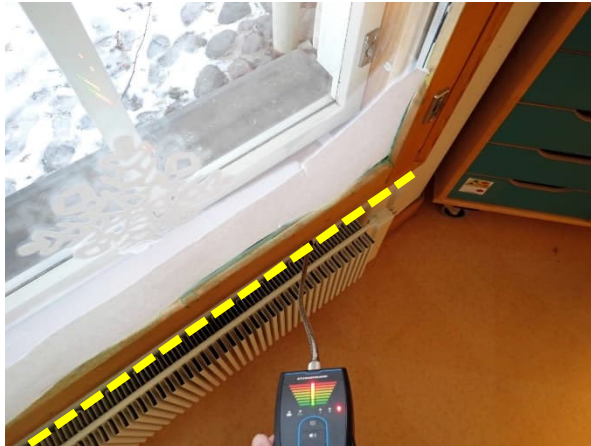
4. Ikkunaliittymästä todettiin vähäistä laaja-alaista ilmavuotoa normaaleissa käyttöolosuhteissa.
