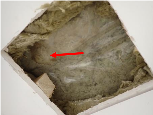
Havainnekuva rakenneavauksesta ja rakenneavauksen kohdalla rakennusmuovin yläpinnassa havaitusta värijäytymästä (punainen nuoli).
