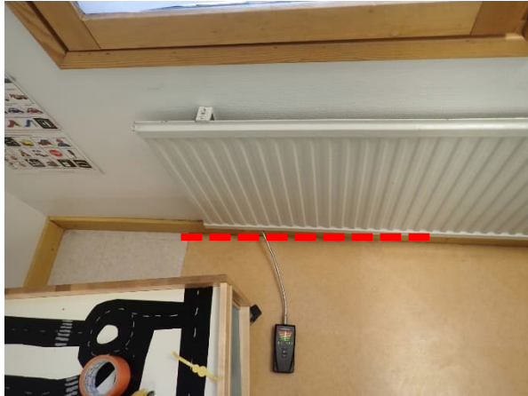
1. Alapohjan ja ulkoseinän liittymästä todettiin merkittävää laaja-alaista ilmavuotoa.
