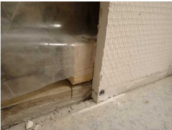
Ulkoseinän höyrynsulkuna käytettyä rakennusmuovia ei ole liitetty ulkoseinän alareunaan.
