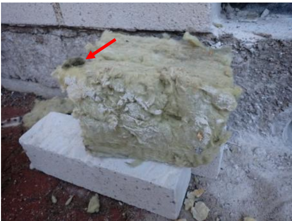
Lämmöneristeenä käytetyssä mineraalivillalevyssä oli havaittavissa vähäistä ilmavuotoihin viittaavaa pölykertymää pystytolpan kohdalla (punainen nuoli).
