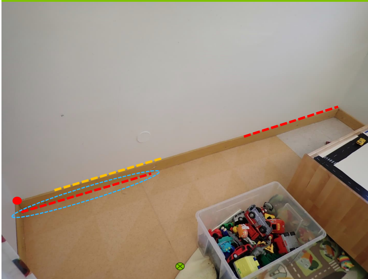
Havaitut vuotokohdat, kaakonpuoleinen ulkoseinälinja
