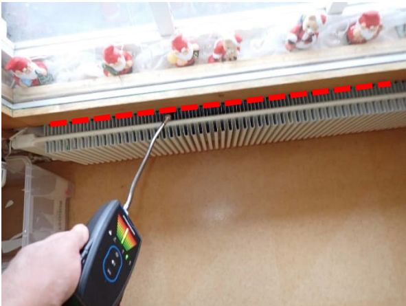
4. Ikkunaliittymästä todettiin merkittävää laaja-alaista ilmavuotoa.
