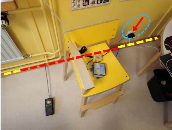
1. Luoteenpuoleisella ulkoseinälinjalla todettiin ulkoseinän ja alapohjan välisestä liittymästä vähäistä tai merkittävää vuotoa. Alipaineistettaessa vuodot vahvistuivat lähes kauttaaltaan merkittäviksi. Myös sähköpistokkeesta havaittiin merkittävää vuotoa.
