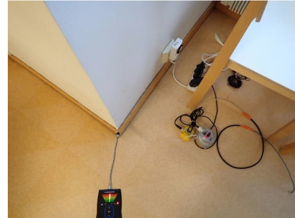
3. Lattialistojen liitoskohdasta havaittiin vähäistä pistemäistä ilmapuotoa.
