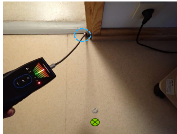
5. Ovikynnyksen reunalta todettiin vähäistä pistemäistä ilmavuotoa tilan ollessa alipaineistettuna.
