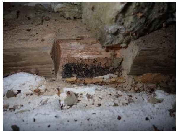
Materiaalinäyte MA.30-US otettiin alaohjauspuun alapinnasta.
