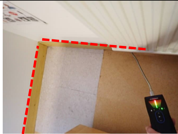
2. Alapohjan ja ulkoseinän liittymistä todettiin merkittävää laaja-alaista ilmavuotoa normaaleissa käyttöolosuhteissa sekä tilan ollessa alipaineistettu.
