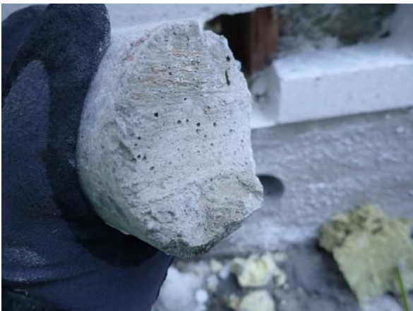
Kuvassa sokkelin sisäpinta, jossa oli vähäinen määrä puutikkuja muottilaudoituksesta. Sokkelihalkaisun ulkopinnassa oleva kartonki oli hankautunut irti rakenneavauksen yhteydessä eikä ollut tarkasteltavissa.
