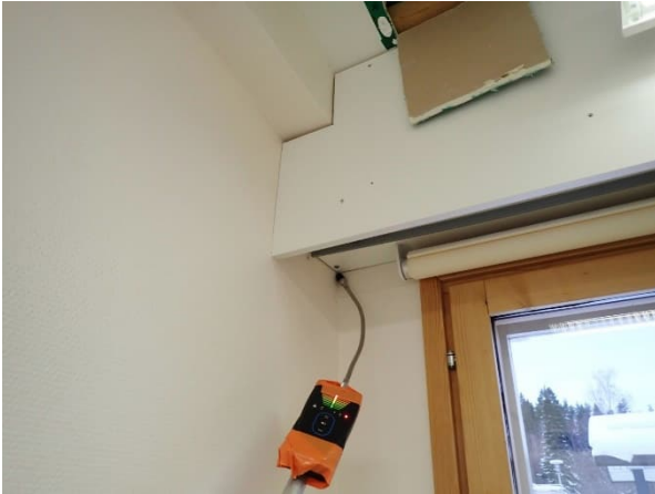
1. Verhokoteloinnin alta havaittiin vähäistä pistemäistä vuotoa.
