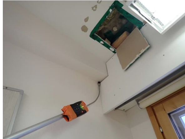
2. Verhokoteloinnin alta havaittiin vähäistä pistemäistä vuotoa.
