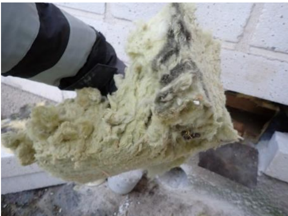
Lämmöneristeenä käytetyssä mineraalivillalevyssä oli havaittavissa vähäistä ilmavuotoihin viittaavaa pölykertymää pystytolpan kohdalla.
