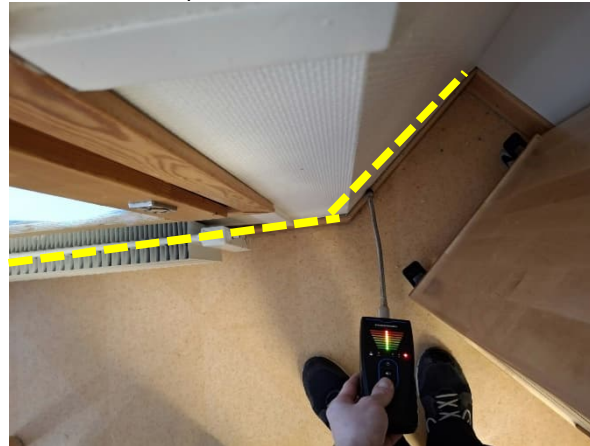
5. Alapohjan ja ulkoseinän liittymästä todettiin vähäistä rakomaista ilmavuotoa normaaleissa käyttöolosuhteissa sekä tilan ollessa alipaineistettuna.
