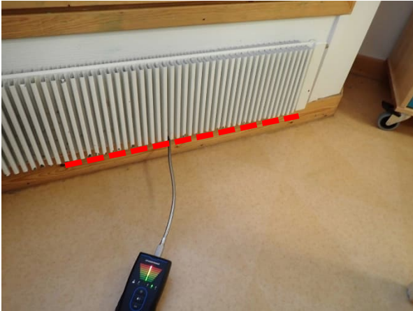
1. Alapohjan ja ulkoseinän liittymästä todettiin merkittävää laaja-alaista ilmapuotoa tilan ollessa alipaineistettu ryömintätilaan nähden. Normaleissa käyttöolosuhteissa vuodot olivat osin heikompia.
