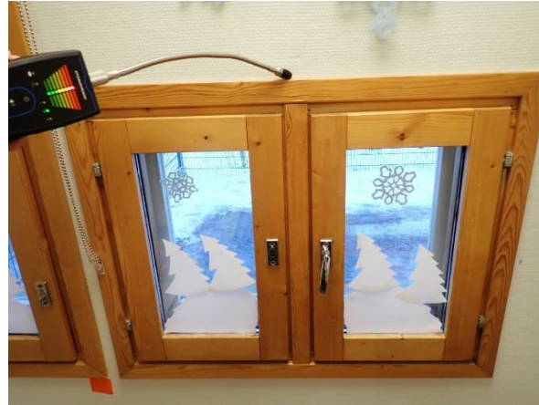
2. Ikkunaliittymän yläreunasta todettiin merkittävää ilmavuotoa kauttaaltaan sekä normaaleissa käyttöolosuhteissa että tilan ollessa alipaineistettu.
