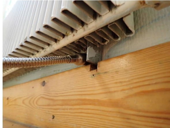
2. Merkittäviä vuotoja havaittiin paikoin patterinkannakkeiden ympärillä.
