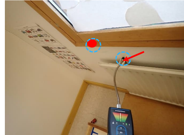
3. Patterinkannakkeesta sekä ikkunaliittymästä todettiin merkittävää pistemäistä vuotoa, kun huonetila alipaineistettiin -10 pascaliin ryömintätilaan nähden.
