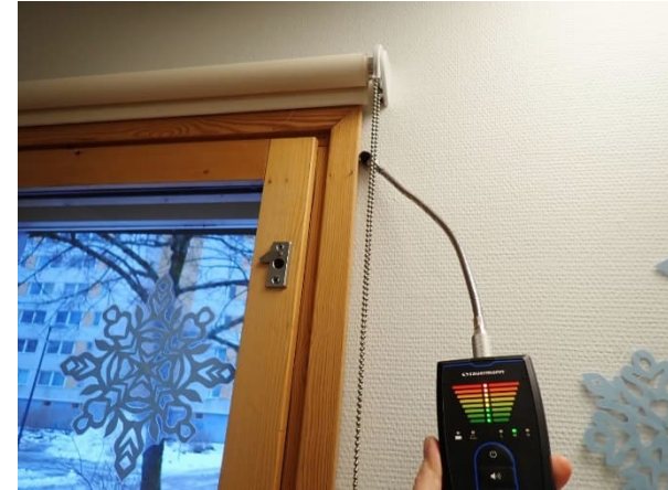
3. Ikkunaliittymän sivureunasta todettiin merkittävää ilmavuotoa kauttaaltaan sekä normaaleissa käyttöolosuhteissa että tilan ollessa alipaineistettu.
