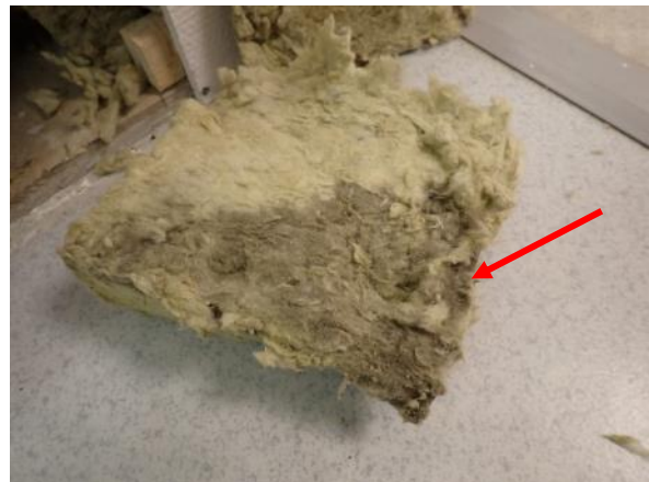
Materiaalinäyte MA.27-US otettiin kuvassa näkyvän mineraalivillalevyn kulmasta (punainen nuoli) kohdasta, jossa oli vähäistä pölykertymää.
