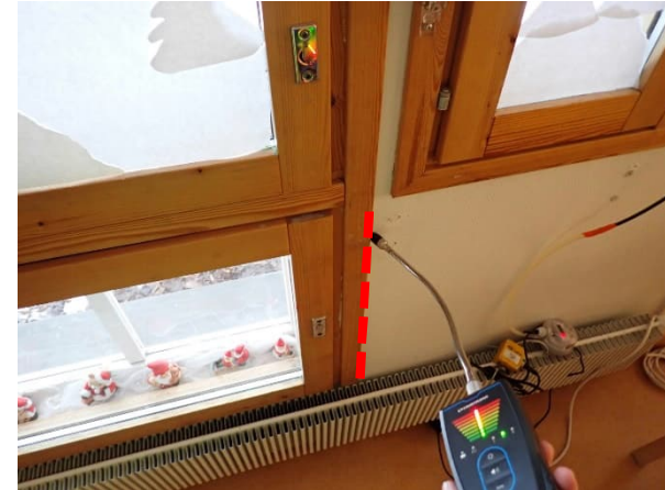
3. Ikkunaliittymästä todettiin merkittävää rakomaista ilmavuotoa tilan normaaleissa käyttöolosuhteissa.
